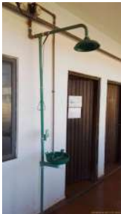
Foto 1 - Chuveiro de emergência.
