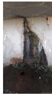
Foto 4 - Vazamentos nas paredes externas dos decantadores.
