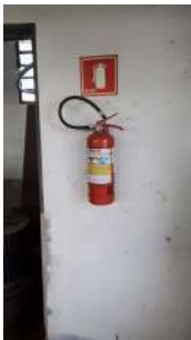
Foto 1 - Extintor na elevatória.
