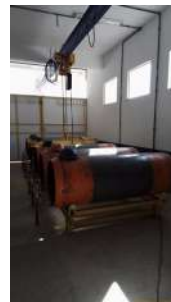
Foto 3 - Tanques para armazenamento de cloro gás.
