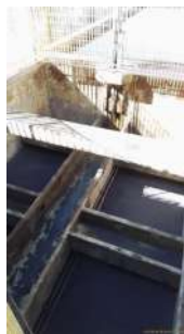
Foto 2 - Filtro da ETA.
