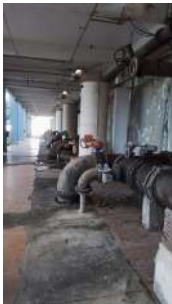
Foto 12 - Saída dos filtros.
