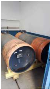
Foto 3 - Tanques para armazenamento de gás cloro.
