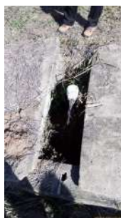
Foto 12 - Macromedidor casa de bombas nova.
