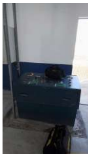
Foto 13 - Antiga mesa de controle de um dos filtros, substituída por painéis elétricos. As mesas estavam sendo removidas durante reforma do prédio da ETA.
