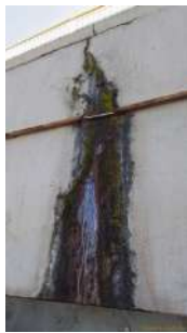
Foto 3 - Vazamentos nas paredes externas dos decantadores.
