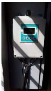
Foto 9 - Macromedidor casa de bombas nova.
