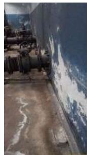
Foto 2 - Tubulação para drenagem da água de lubrificação das gaxetas.
