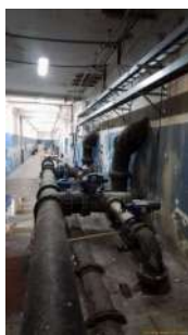
Foto 18 - Saída dos filtros.
