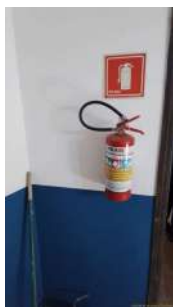
Foto 1 - Extintor na sala de cloro gás.
