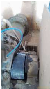
Foto 1 - Detalhe da drenagem da água de lubrificação das gaxetas de uma das bombas.
