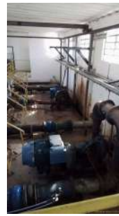
Foto 16 - Casa de bombas velha, com duas bombas centrífugas e duas submersas.
