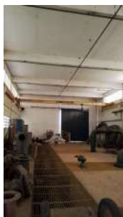
Foto 1 - Ponte rolante na casa de bombas.
