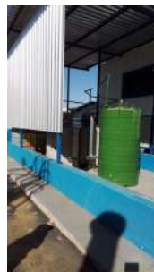
Foto 6 - Área de estocagem de dióxido de cloro.
