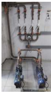
Foto 1 - Sistema para mistura de cloro gás na água tratada.
