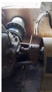
Foto 3 - Drenagem de uma das bombas da casa velha.
