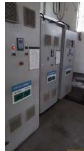
Foto 2 - Paineis de comando da casa de bombas nova, sempre com ao menos uma reserva.
