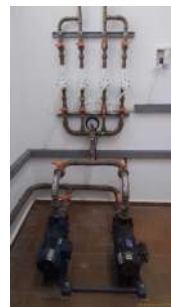
Foto 2 - Mistura do cloro gás à água tratada.
