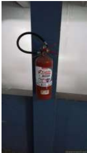
Foto 1 - Extintor na elevatória.
