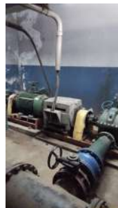
Foto 2 - Bomba da elevatória.
