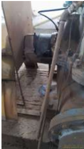
Foto 3 - Detalhe da drenagem da água de lubrificação.
