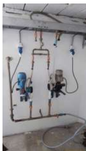
Foto 16 - Bombas dosadoras de PAC.
