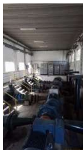
Foto 8 - Casa de bombas nova, com quatro bombas centrífugas.
