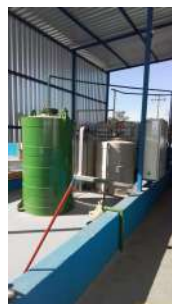
Foto 7 - Área de estocagem de dióxido de cloro.
