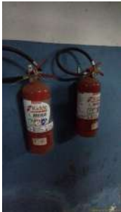
Foto 2 - Extintor na elevatória.
