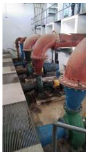
Foto 5 - 5 bombas em paralelo, sendo que em geral ao menos 2 permanecem como reserva.
