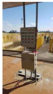
Foto 2 - Painel de um dos filtros.
