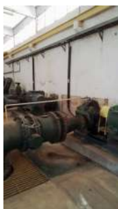
Foto 1 - Bombas 1 a 3 grandes funcionam em paralelo, com ao menos uma reserva.
