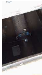
Foto 3 - Macromedidor em uma das 2 entradas de água bruta.
