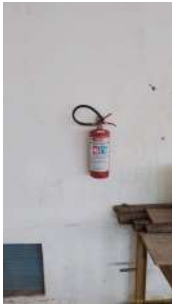
Foto 1 - Extintor na captação.
