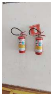
Foto 2 - Extintores na ETA II.
