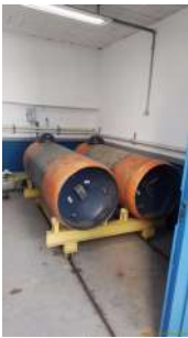
Foto 4 - Tanques para armazenamento de gás cloro.
