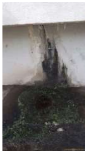
Foto 1 - Vazamentos nas paredes externas dos decantadores.
