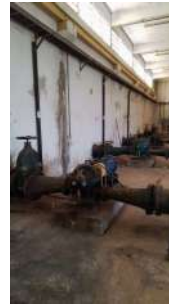
Foto 9 - Bombas pequenas 1 a 3 funcionam em paralelo.
