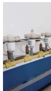
Foto 5 - Tubulação de cloro gás.
