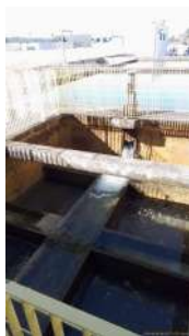
Foto 1 - Um dos filtros da ETA.
