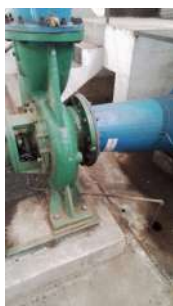
Foto 1 - Drenagem da água de lubrificação das gaxetas de uma das bombas.
