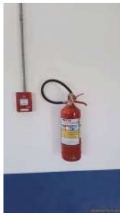
Foto 1 - Um dos extintores existentes no local.
