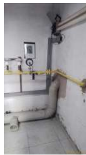
Foto 2 - Tubulação de cloro gás.
