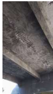
Foto 2 - Laje com armadura exposta.
