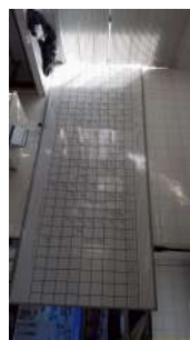
Foto 5 - Controle da lavagem dos filtros.
