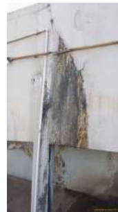
Foto 2 - Vazamentos nas paredes externas dos decantadores.
