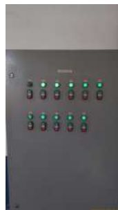
Foto 14 - Painel de controle dos 11 floculadores mecanizados.
