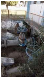
Foto 1 - Tubulação de saída da elevatória.
