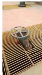
Foto 2 - Vazamento verificado em Registro da bomba grande 3.
