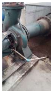
Foto 2 - Drenagem da água de lubrificação das gaxetas de uma das bombas.
