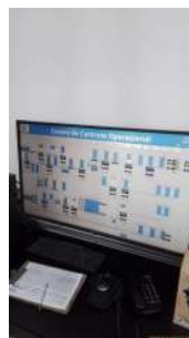
Foto 15 - CCO exibindo sistema de telemetria. Observa-se verificação de nível de diversos reservatórios.
