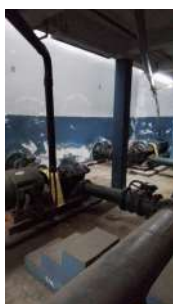
Foto 3 - Interior da casa de bombas.
