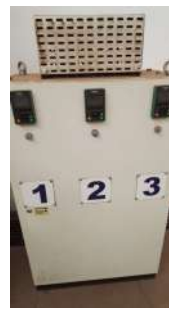
Foto 7 - Duas bombas em operação e uma parada.
