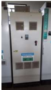
Foto 3 - Painel da bomba 4.
