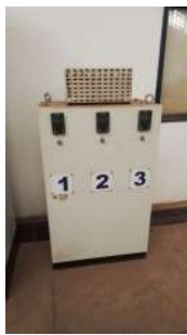
Foto 6 - Painel de comando das bombas 1 a 3 pequenas.
