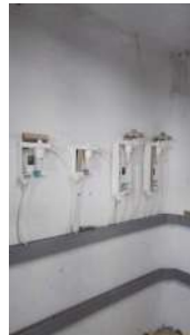
Foto 3 - Dosagem de cloro gás, que pode ser utilizado tanto na pós cloração como na pré cloração, sendo que esta é feita principalmente por dióxido de cloro.
