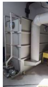
Foto 4 - Lavador de cloro gás.
