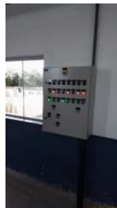
Foto 12 - Painel de controle de um dos filtros.
