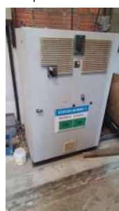
Foto 7 - Painel de comando da bomba submersa.
