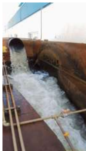
Foto 3 - Entrada de água bruta.
