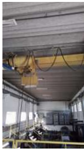
Foto 1 - Ponte rolante da casa de bombas nova.
