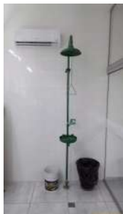
Foto 1 - Chuveiro de emergência no laboratório.
