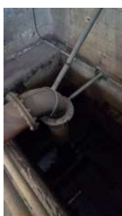
Foto 5 - Bomba 1 submersa que trabalha em conjunto com as bombas 3 a 6.
