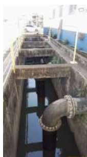
Foto 14 - Poços de sucção da casa de bombas nova.
