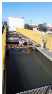
Foto 6 - 11 misturadores mecanizados para floculação.
