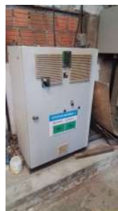
Foto 2 - Pannel da bomba submersa, que funciona em paralelo às bombas 3 a 6.
