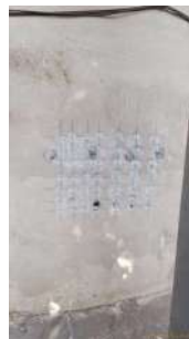
Foto 2 - Foram realizados ensaios para avaliação das patologias e da estrutura do reservatório, visando a sua reforma, custeados por empreendedor.
