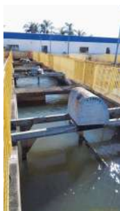
Foto 7 - Misturadores mecanizados para floculação.
