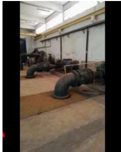
Foto 8 - Bombas grandes 1 a 3 funcionam em paralelo.
