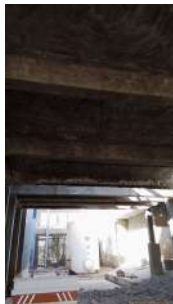
Foto 1 - Laje que sustentava tanques para armazenamento de produtos químicos utilizados no tratamento. No momento da Fiscalização a laje estava sendo demolida.
