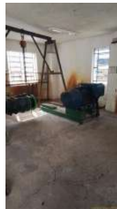
Foto 2 - Espaço amplo para manutenção.
