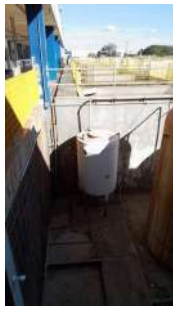
Foto 1 - Armazenamento flúor em local provisório.
