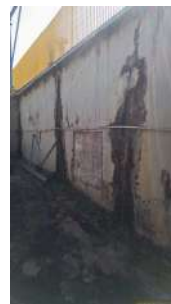
Foto 6 - Vazamentos nas paredes externas dos decantadores.
