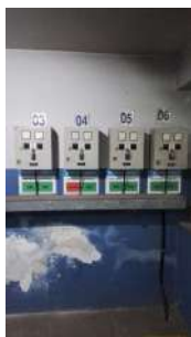
Foto 1 - Painéis de comando das Bombas centrífugas, que funcionam em paralelo e sempre com ao menos uma reserva.
