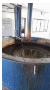
Foto 7 - Tulipa de entrada de água bruta.
