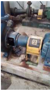
Foto 3 - Drenagem da água de lubrificação das gaxetas de uma das bombas.
