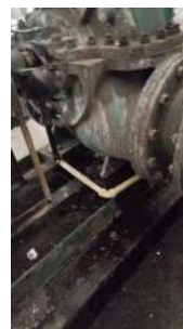
Foto 4 - Drenagem da água de lubrificação das gaxetas de uma das bombas.
