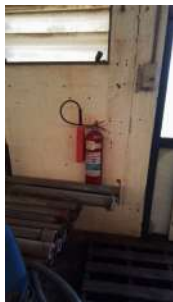
Foto 1 - Extintor na estação.
