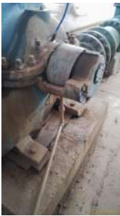
Foto 2 - Detalhe da drenagem da água de lubrificação das gaxetas de uma das bombas.
