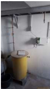
Foto 1 - Bomba dosadora de flúor.
