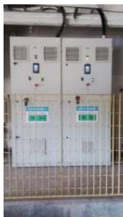
Foto 5 - Painéis de comando das bombas da casa velha.
