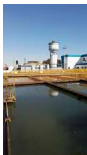
Foto 9 - Visão geral da ETA.
