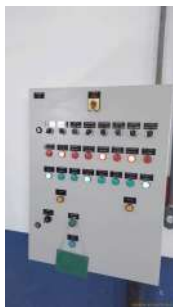
Foto 10 - Painel de controle de um dos filtros. Os painéis substituíram recentemente antigas mesas de controle.
