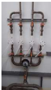
Foto 1 - Sistema que realiza a mistura do gás cloro à água tratada.
