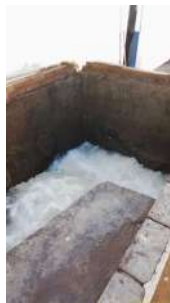
Foto 4 - Entrada de água bruta.
