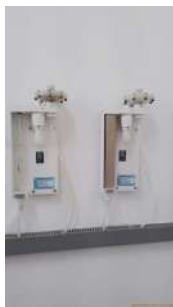
Foto 3 - Dosagem de cloro gás.
