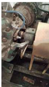
Foto 3 - Drenagem da água de lubrificação das gaxetas de uma das bombas.
