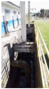
Foto 15 - Poço de sucção da casa de bombas velha.
