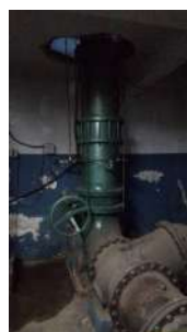
Foto 4 - Recalque das bombas 3 a 6.
