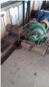
Foto 4 - Água de lubrificação encaminhada para canaleta.
