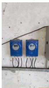
Foto 4 - Display dos medidores de vazão da captação.
