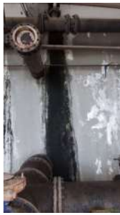
Foto 1 - Vazamento na parede externa da saída dos filtros.
