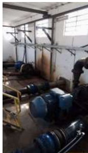
Foto 5 - Casa de bombas velha: duas bombas anfíbias e 2 centrífugas, sempre com reserva.
