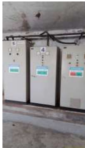
Foto 3 - Painéis de comando da casa nova.
