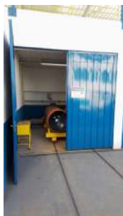
Foto 1 - Armazenamento de cloro gás.
