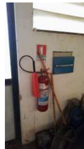
Foto 2 - Extintor na estação.
