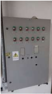
Foto 9 - Painei de comando dos 12 misturadores mecanizados dos floculadores.
