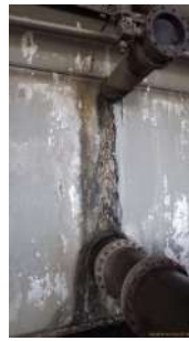
Foto 2 - Vazamento na parede externa da saída dos filtros.
