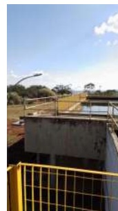
Foto 2 - Guarda-corpo corpo em questão será adequado.
