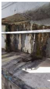
Foto 5 - Vazamentos nas paredes externas dos decantadores.
