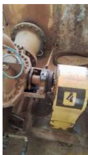
Foto 1 - Drenagem da água de lubrificação das gaxetas de uma das bombas da casa nova.
