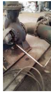
Foto 6 - Drenagem da água de lubrificação das gaxetas de uma das bombas.
