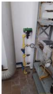
Foto 1 - Tubulação de cloro gás.
