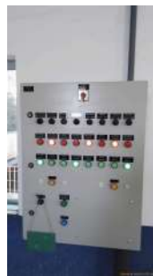
Foto 11 - Painel de controle de um dos filtros.
