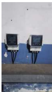
Foto 6 - Display dos medidores de vazão de entrada de água bruta.
