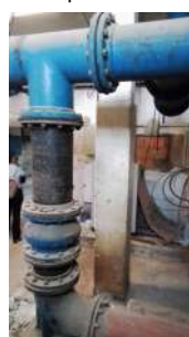
Foto 6 - Recalque da bomba submersa.
