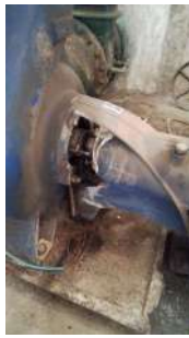
Foto 5 - Drenagem da água de lubrificação das gaxetas de uma das bombas.
