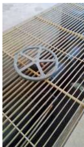
Foto 1 - Vazamento verificado em Registro da bomba 1 pequena.
