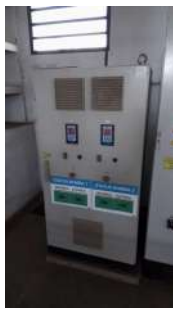
Foto 1 - Painel de comando das bombas 1 e 2.
