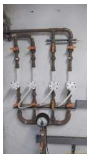
Foto 4 - Pontos de mistura do cloro gás com a água.
