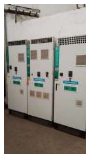
Foto 2 - Pannel de comando das bombas grandes.
