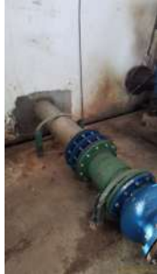
Foto 17 - Recalque de uma das bombas anfíbias da casa de bombas velha.
