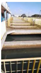
Foto 4 - Filtros da ETA.
