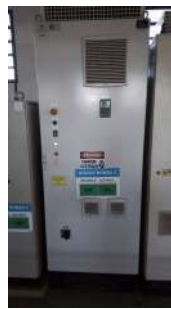
Foto 2 - Painel da bomba 3.
