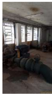
Foto 2 - Bombas na casa nova.
