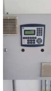
Foto 18 - Painele de comando da casa velha.
