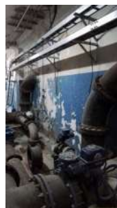
Foto 17 - Saída dos filtros.
