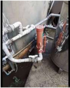
Foto 3 - Tubulações de do sistema de filtração antes da entrada no reservatório.
