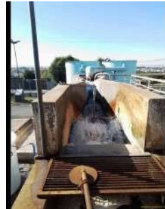
Foto 8 - Aplicação de PAC após a calha parshall.
