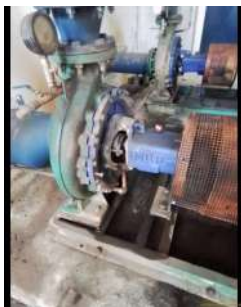
Foto 1 - Detalhe da tubulação para drenar a água de lubrificação da gaxeta de uma das bombas.
