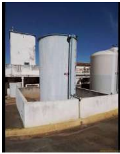
Foto 3 - Armazenamento de PAC (coagulante).
