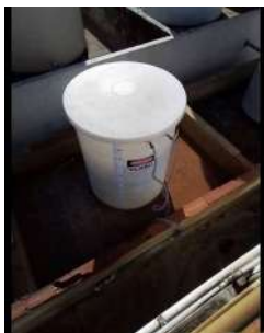
Foto 1 - Tanque para armazenar cloro.
