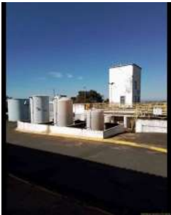
Foto 1 - Visão geral da ETA I
