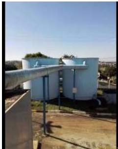
Foto 9 - Tanques para decantar areia da água bruta.
