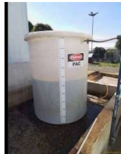
Foto 12 - Tanque para armazenar PAC (coagulante)
