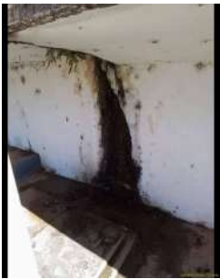
Foto 1 - Infiltração nos floculadores.
