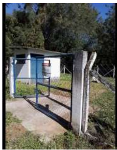
Foto 1 - Visão geral da elevatória de esgoto.
