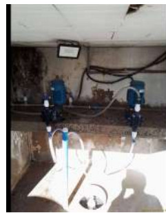
Foto 4 - Bombas dosadoras de hipoclorito de cloro.
