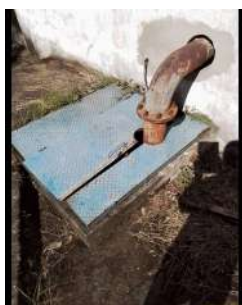
Foto 1 - Tubulação de sucção do reservatório para a elevatória.
