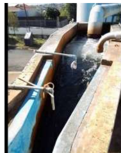
Foto 2 - Aplicação de cloro na entrada de água bruta.
