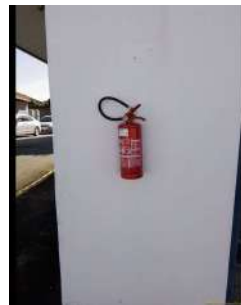
Foto 2 - Extintor na ETA.
