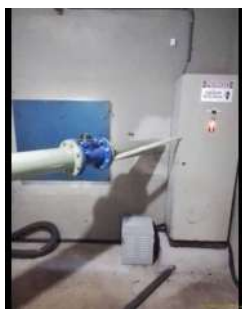
Foto 3 - Recalque da elevatória.
