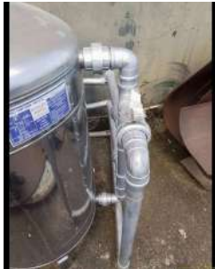
Foto 9 - Entrace saída do filtro antes do abastecimento do reservatório.
