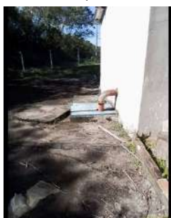
Foto 5 - Succção no reservatório enterrado Jamil.
