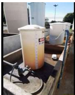
Foto 3 - Tanque para armazenar flúor.
