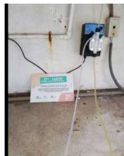
Foto 4 - Bomba dosadora e identificação da etapa de cloração e fluoretação.
