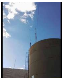
Foto 3 - Para-raios na cobertura do reservatório.
