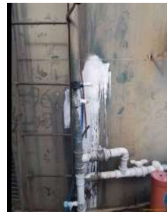
Foto 6 - Aplicação de flúor na alimentação do reservatório.
