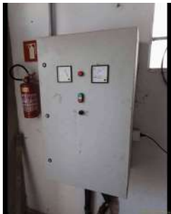
Foto 2 - Painel de comando.
