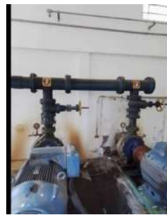
Foto 2 - Recalque das bombas.
