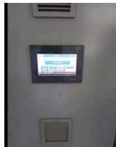
Foto 6 - Sistema de Telemetria para monitoramento das bombas no CCO.
