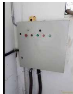
Foto 2 - Painel de comando das bombas.
