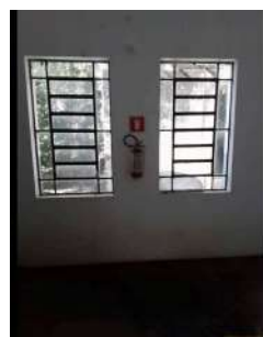
Foto 2 - Extintor na captação.
