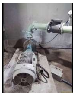
Foto 1 - Bomba da elevatória.
