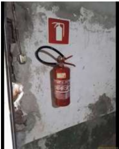
Foto 1 - Extintor na elevatória.
