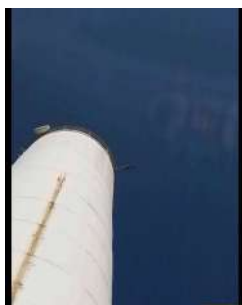
Foto 1 - Para-raios na cobertura.
