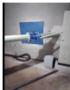
Foto 2 - Recalque da elevatória.
