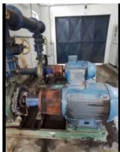
Foto 1 - Duas bombas instaladas. A terceira estava em manutenção.
