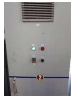
Foto 2 - Pannel de comando de uma das bombas.
