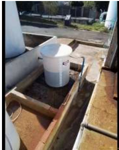
Foto 7 - Tanque para armazenamento de PAC.
