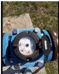
Foto 1 - Macromedidor no cavalete do poço.
