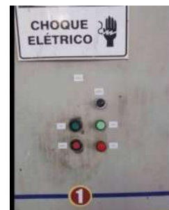
Foto 3 - Pannel de comando de uma das bombas.
