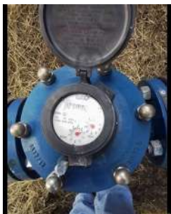
Foto 1 - Macromedidor no cavalete.
