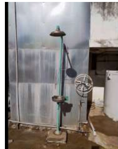
Foto 2 - Chuveiro de emergência na área onde estão armazenados os produtos químicos utilizados no tratamento.
