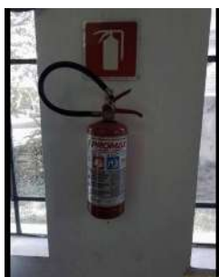
Foto 1 - Extintor na captação.
