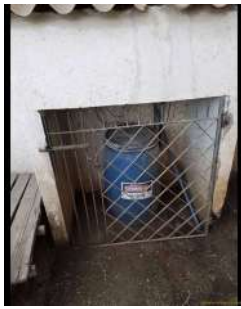
Foto 5 - Armazenamento e dosagem de flúor.
