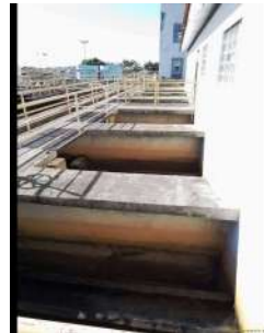
Foto 10 - Filtros da ETA. Há seis, mas 3 estava aptos a operar.
