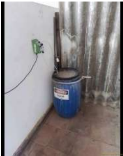
Foto 2 - Armazenamento e dosagem de flúor.
