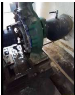
Foto 3 - Detalhe da tubulação para drenar a água de lubrificação da gaxeta de uma das bombas.
