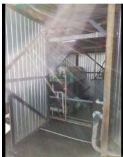
Foto 5 - Skid para tratamento do lodo.
