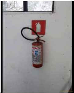
Foto 1 - Extintor na elevatória.
