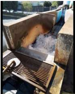
Foto 4 - Calha parshall na entrada de água bruta.
