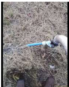
Foto 1 - Torneira para coleta de água bruta.
