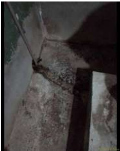
Foto 1 - Canaleta para escoar a área de lubrificação.
