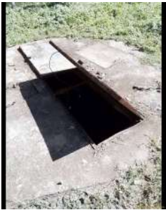
Foto 1 - Cesto peneira instalado no poço. De acordo com o funcionário, ocorre limpeza de 2 a 3 vezes por semana, sendo que o cesto é erguido com auxílio de maquinário (retro).
