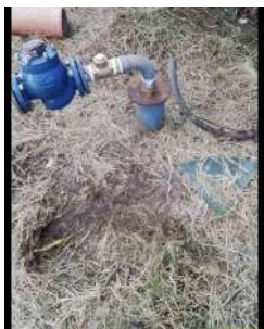
Foto 1 - Laje de concreto estava coberta por grama cortada.
