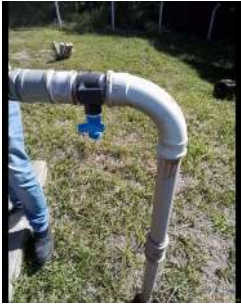
Foto 1 - Torneira para tomada de água bruta.
