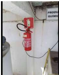
Foto 1 - Extintor junto aos produtos químicos.
