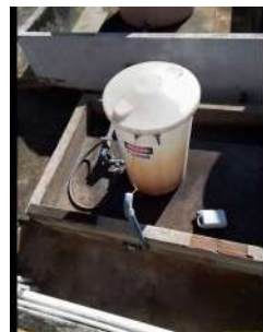
Foto 2 - Tanque para armazenar ácido fluossilícico (flúor).
