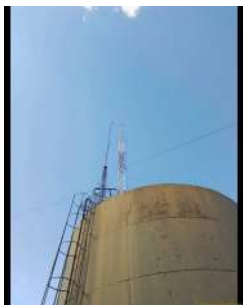
Foto 1 - Para-raios na cobertura do reservatório.
