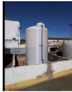
Foto 4 - Armazenamento de Hipoclorito de sódio.
