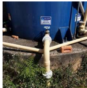
Foto 10 - Tubulação de saída para distribuição.
