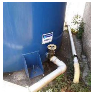
Foto 12 - Tubulação de saída para distribuição.
