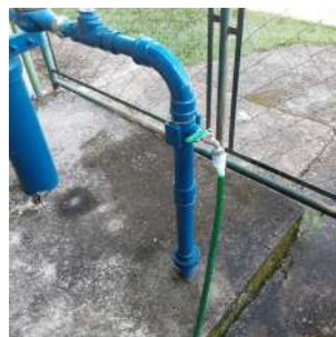
Foto 5 - Torneira para coleta de água bruta.
