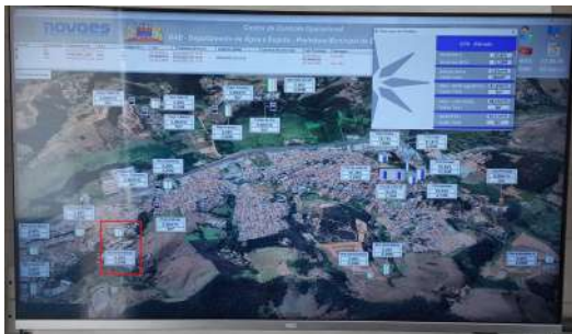
Foto 13 - O prestador já possui infraestrutura de telemetria instalada no local, como pode ser observado na tela do supervisor do sistema, porém, devido à falta de manutenção dos equipamentos, a medição de nível não está funcionando neste reservatório.
