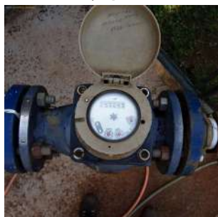
Foto 3 - Macromedidor de vazão.
