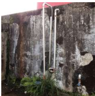
Foto 5 - Medidor de nível.
