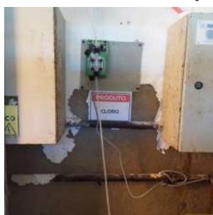
Foto 9 - Detalhe da bomba dosadora de cloro.
