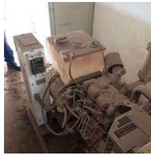
Foto 2 - Vista geral do interior da edificação. É possível notar que não é realizada a limpeza e manutenção dos equipamentos.
