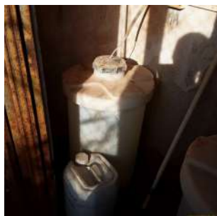
Foto 11 - Tanque de armazenamento de flúor na área lateral da edificação.
