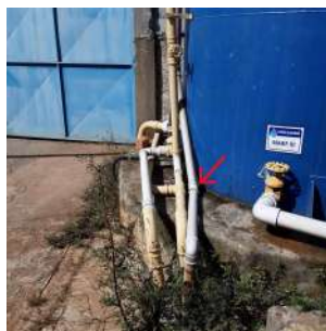
Foto 8 - A seta indica o tubo extravasor. À direita, tubulação de saída para distribuição.
