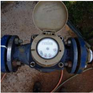
Foto 3 - Macromedidor de vazão.
