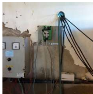
Foto 10 - Detalhe da bomba dosadora de flúor.
