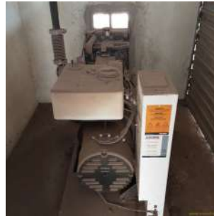
Foto 3 - Detalhe do gerador de energia elétrica.
