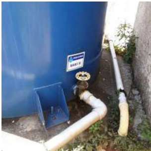
Foto 12 - Tubulação de saída para distribuição.
