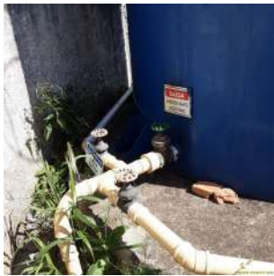
Foto 11 - Tubulação de saída para distribuição.
