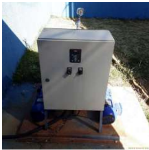
Foto 5 - Painel de acionamento e controle das bombas.
