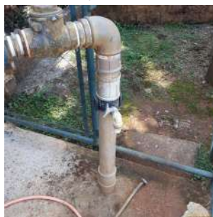
Foto 4 - Torneira para coleta de água bruta.
