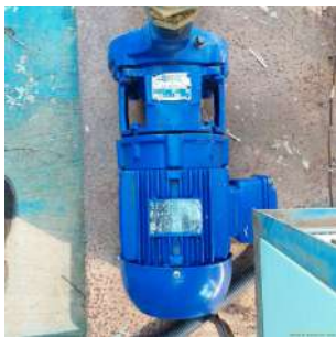
Foto 3 - Detalhe do conjunto moto bomba 1.
