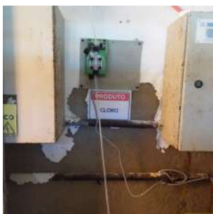
Foto 9 - Detalhe da bomba dosadora de cloro.
