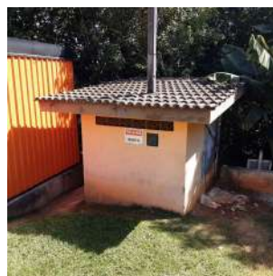
Foto 6 - Vista geral da edificação que abriga os painéis elétricos e equipamentos de aplicação de cloro e fluor na água bruta. Há uma placa de identificação do poço na fachada da edificação.
