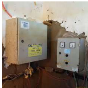
Foto 11 - Painéis elétricos das bombas dosadoras.
