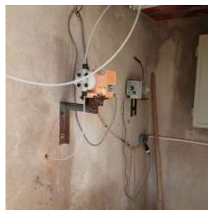
Foto 10 - Bombas dosadoras de cloro e flúor.
