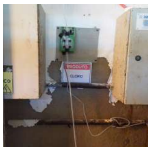
Foto 9 - Detalhe da bomba dosadora de cloro.
