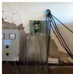
Foto 10 - Detalhe da bomba dosadora de flúor.
