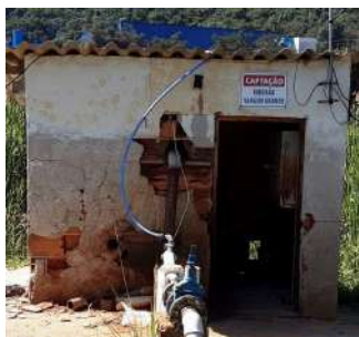
Foto 1 - Edificação com alvenaria danificada.
