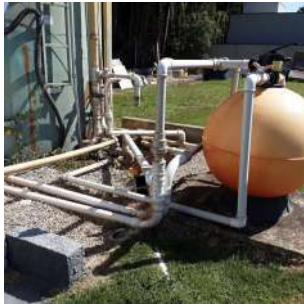
Foto 5 - Vista geral das tubulações de entrada e saída do reservatório.
