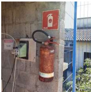
Foto 8 - Extintor de incêndio instalado próximo às bombas dosadoras e painel elétrico.
