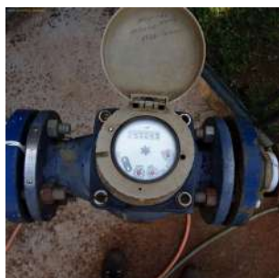
Foto 3 - Macromedidor de vazão.
