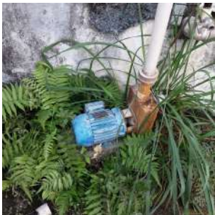
Foto 6 - Há uma tubulação conectada a uma pequena bomba que era utilizada para abastecimento de caminhões pipa.
