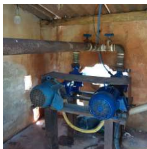
Foto 4 - Vista geral da elevatória da captação. Há dois conjuntos motobomba, um em funcionamento e o outro como reserva.
