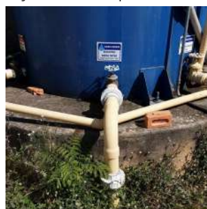
Foto 10 - Tubulação de saída para distribuição.
