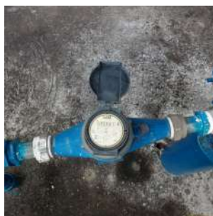
Foto 4 - Macromedidor de vazão.
