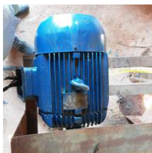
Foto 5 - Detalhe do conjunto motobomba 1.
