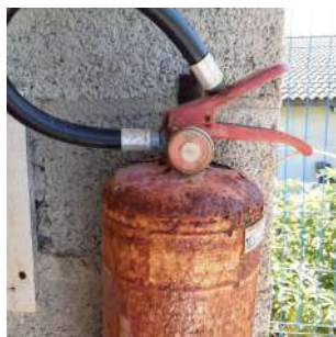
Foto 1 - Detalhe da oxidação do extintor, impossibilitando a verificação do controle de manutenções.
