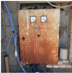
Foto 1 - Detalhe da oxidação no painel elétrico.
