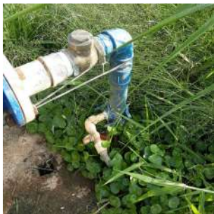
Foto 6 - Torneira para coleta de água bruta.
