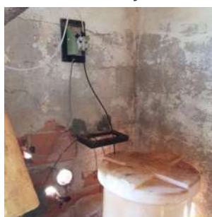
Foto 10 - Tanque e bomba dosadora de cloro empregados na pré-cloração da água bruta.
