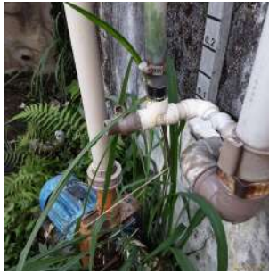
Foto 7 - Detalhe da torneira para coleta de água do reservatório.
