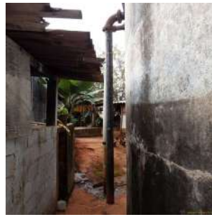
Foto 6 - Tubulações de entrada de água no reservatório.
