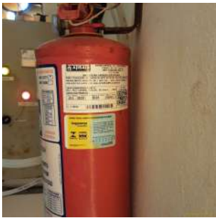
Foto 14 - Detalhe da etiqueta de controle de manutenções do extintor - dentro da validade.
