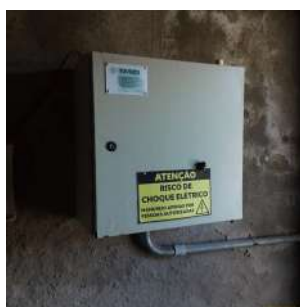
Foto 9 - Painelelétrico da bomba dosadora.
