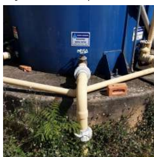
Foto 10 - Tubulação de saída para distribuição.
