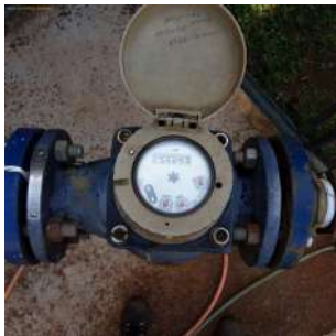
Foto 3 - Macromedidor de vazão.
