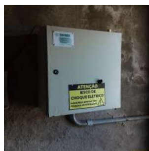
Foto 9 - Painel elétrico da bomba dosadora.
