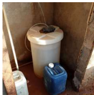
Foto 12 - Tanque de armazenamento de cloro na área lateral da edificação.
