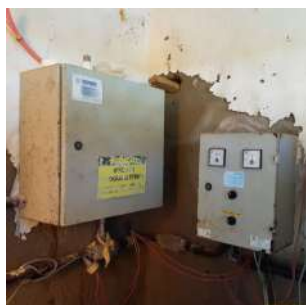
Foto 11 - Painéis elétricos das bombas dosadoras.
