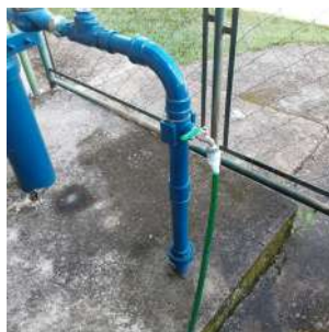
Foto 5 - Torneira para coleta de água bruta.
