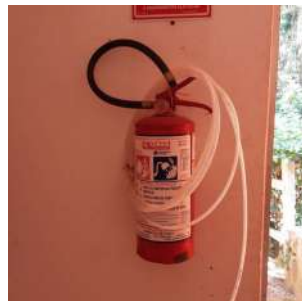
Foto 13 - Extintor de incêndio instalado no interior da edificação.
