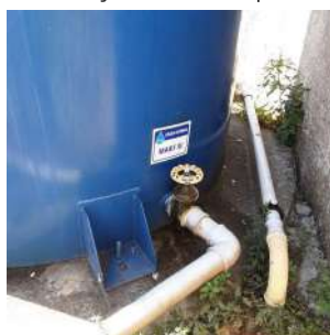
Foto 12 - Tubulação de saída para distribuição.
