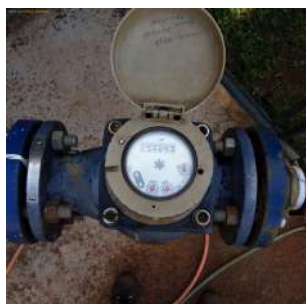
Foto 3 - Macromedidor de vazão.
