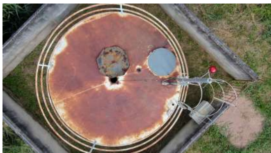
Foto 1 - Detalhe da abertura de ventilação sem qualquer proteção, ocasionando o risco de contaminação por água da chuva, poeira ou entrada de animais.
