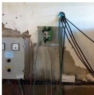
Foto 10 - Detalhe da bomba dosadora de flúor.
