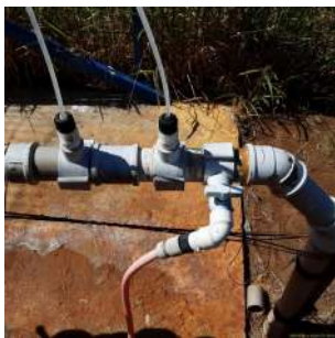
Foto 5 - Ponto de aplicação de cloro e flúor e, em seguida, a torneira para coleta de água bruta. Segundo informações do prestador, as bombas dosadoras são desligadas antes de realizar as coletas de água bruta para análise.
