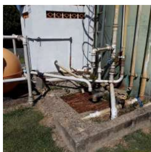
Foto 6 - Vista geral das tubulações de entrada e saída do reservatório.
