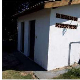
Foto 2 - Edificação que abriga os equipamentos para cloração e fluoretação da água captada no Poço vale do Sol.
