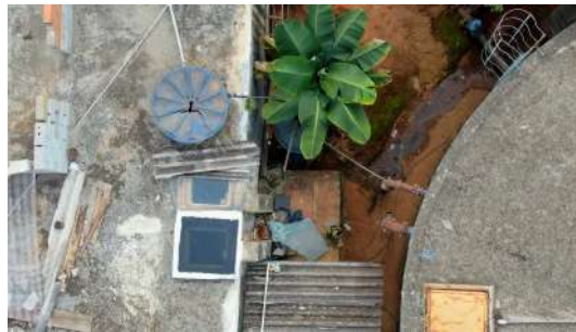
Foto 2 - Detalhe das aberturas de inspeção do reservatório que foram adaptadas para funcionar como claraboias. Ao lado há uma caixa d'água conectada a algumas tubulações, nota-se também que a tampa dessa caixa d'água está rachada, o que pode ocasionar a contaminação dessa água.
