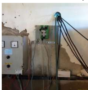
Foto 10 - Detalhe da bomba dosadora de flúor.
