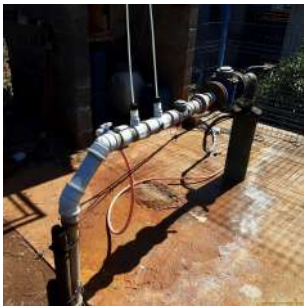
Foto 2 - Detalhe da solução improvisada para contenção da tubulação do poço.
