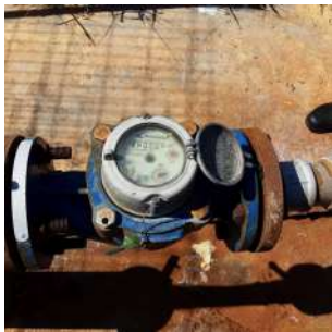
Foto 4 - Macromedidor de vazão.
