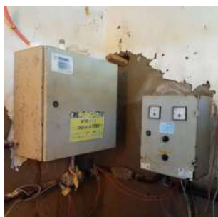
Foto 11 - Painéis elétricos das bombas dosadoras.
