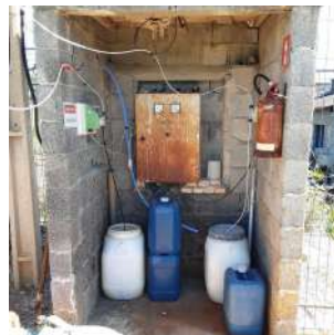
Foto 7 - Abrigo do painel elétrico e dos tanques de armazenamento e bombas dosadoras de cloro e flúor.
