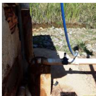
Foto 11 - Ponto de aplicação de cloro - pré-cloração da água bruta.
