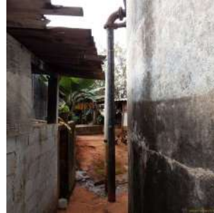
Foto 6 - Tubulações de entrada de água no reservatório.
