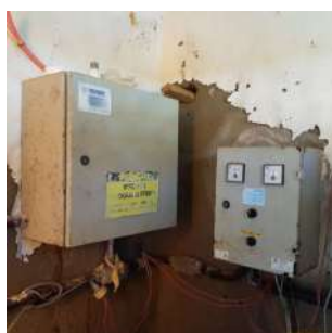
Foto 11 - Painéis elétricos das bombas dosadoras.
