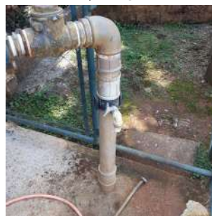
Foto 4 - Torneira para coleta de água bruta.
