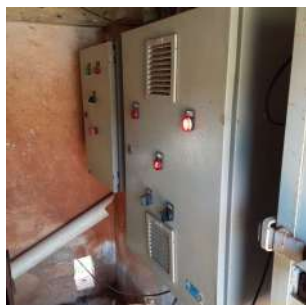
Foto 7 - Painéis elétricos no interior da edificação.
