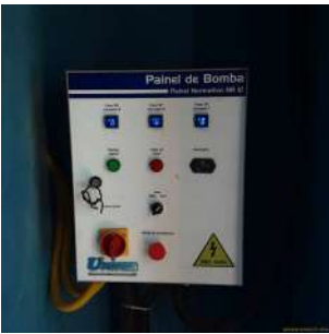
Foto 6 - Painel elétrico das bombas.
