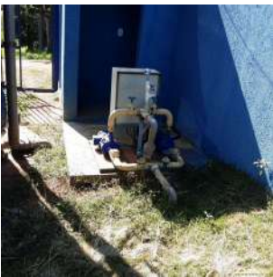
Foto 2 - Vista geral da elevatória. Há dois conjuntos moto-bomba instalados, um em funcionamento e o segundo como reserva.
