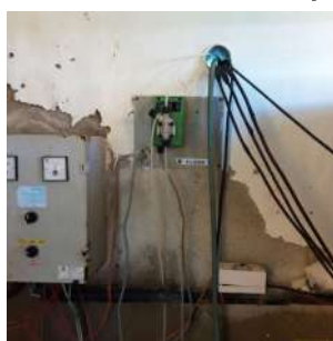
Foto 10 - Detalhe da bomba dosadora de flúor.
