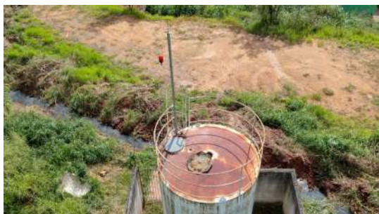
Foto 5 - Haste do para-raios no topo do reservatório.
