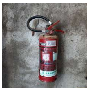
Foto 10 - Extintor de incêndio instalado no interior da edificação.
