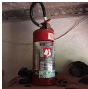
Foto 8 - Extintor de incêndio instalado no interior da edificação.
