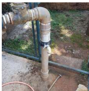
Foto 4 - Torneira para coleta de água bruta.
