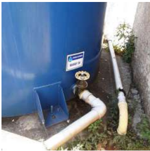
Foto 12 - Tubulação de saída para distribuição.
