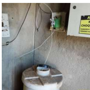
Foto 8 - Tanque de armazenamento e bomba dosadora de cloro.
