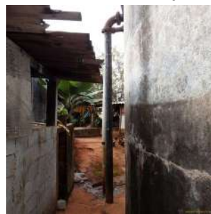
Foto 4 - Outro ângulo do ponto anterior. À esquerda está a área de serviço da habitação, no centro da imagem é possível notar o escoamento de líquido sobre o solo, aparentemente vindo da caixa d'água instalada no solo.
