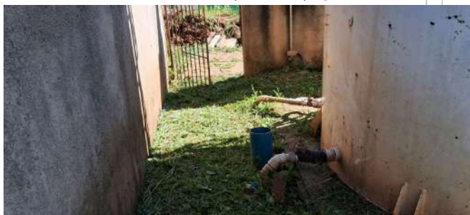
Foto 7 - Registro de saída da água para distribuição por gravidade.
