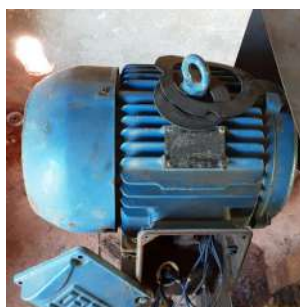
Foto 6 - Detalhe do conjunto motobomba 2.
