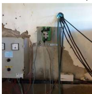
Foto 10 - Detalhe da bomba dosadora de flúor.
