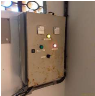
Foto 12 - Pannel elétrico da bomba do poço.
