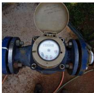
Foto 3 - Macromedidor de vazão.
