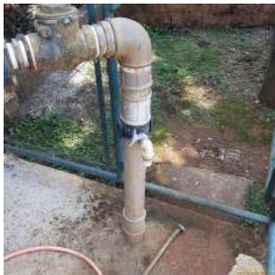
Foto 4 - Torneira para coleta de água bruta.
