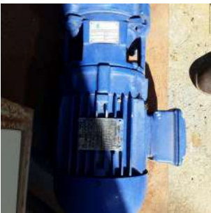
Foto 4 - Detalhe do conjunto moto bomba 2.
