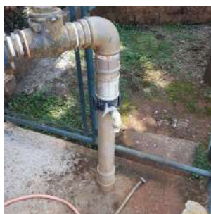
Foto 4 - Torneira para coleta de água bruta.
