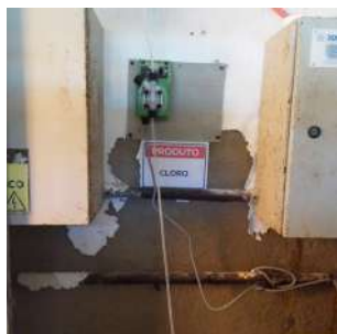
Foto 9 - Detalhe da bomba dosadora de cloro.
