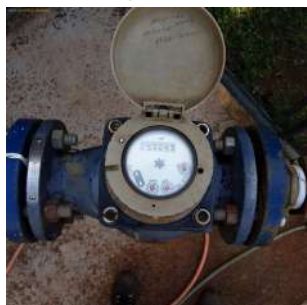
Foto 3 - Macromedidor de vazão.
