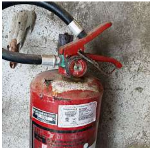
Foto 1 - A etiqueta de controle de manutenções do extintor foi apagada pela ação do tempo.
