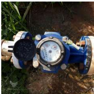
Foto 5 - Macromedidor de vazão.
