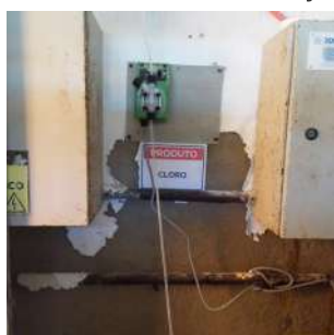
Foto 9 - Detalhe da bomba dosadora de cloro.
