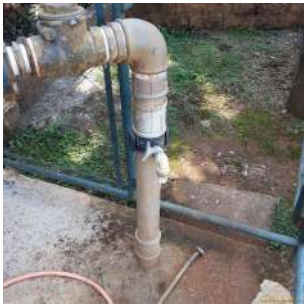
Foto 4 - Torneira para coleta de água bruta.
