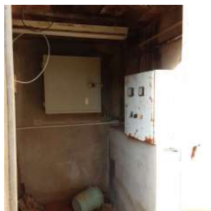
Foto 9 - Painéis elétricos no interior da edificação.
