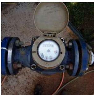
Foto 3 - Macromedidor de vazão.
