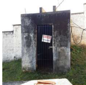
Foto 7 - Vista geral da edificação que abriga os equipamentos de aplicação de cloro na água bruta. Essa edificação está localizada nos fundos da escola, ao lado do Reservatório Cachoeirinha.
