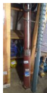
Foto 14 - Bomba reserva do poço armazenada no almoxarifado da Sede.
