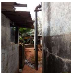
Foto 6 - Tubulações de entrada de água no reservatório.
