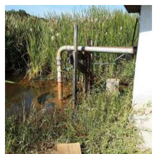
Foto 9 - Poço de captação no Ribeirão Vargem Grande.
