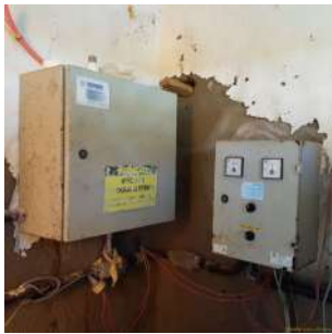
Foto 11 - Painéis elétricos das bombas dosadoras.
