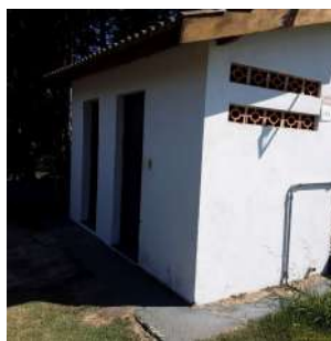
Foto 2 - Edificação que abriga os equipamentos para cloração e fluoretação da água captada no Poço vale do Sol.
