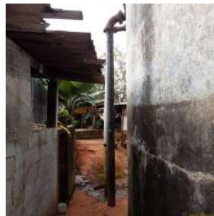
Foto 6 - Tubulações de entrada de água no reservatório.
