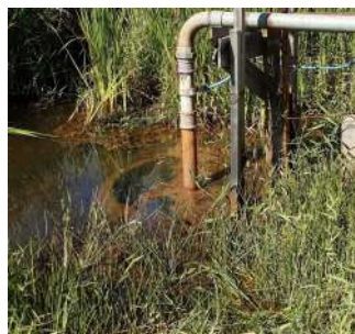
Foto 2 - Detalhe do ponto de captação.
