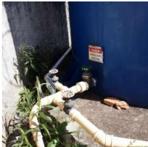
Foto 11 - Tubulação de saída para distribuição.
