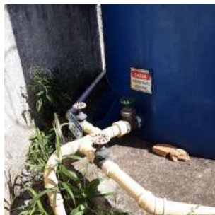
Foto 11 - Tubulação de saída para distribuição.
