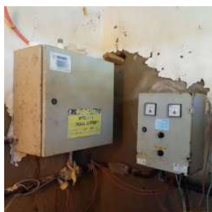
Foto 11 - Painéis elétricos das bombas dosadoras.
