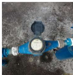
Foto 4 - Macromedidor de vazão.
