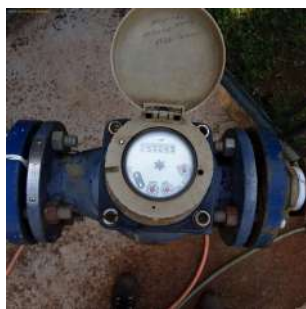
Foto 3 - Macromedidor de vazão.
