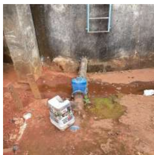
Foto 7 - Tubulação de saída da água distribuída por gravidade.
