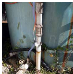
Foto 7 - Mangueira de medição de nível e ponto de aplicação de cloro na água bruta que vem do Poço Vale do Sol.
