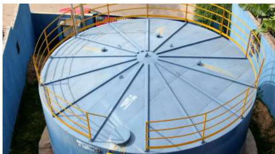
Foto 7 - Vista geral do topo do reservatório. É possível observar as condições dos guarda-corpos, da tampa de inspeção e dos tubos de ventilação.
