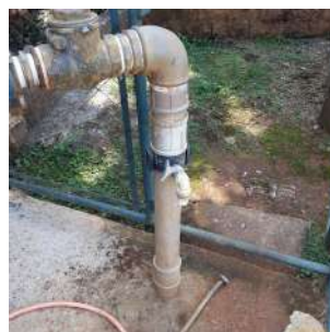
Foto 4 - Torneira para coleta de água bruta.
