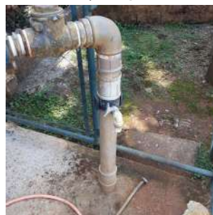
Foto 4 - Torneira para coleta de água bruta.
