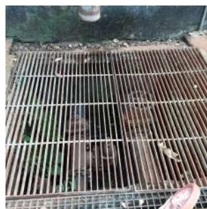
Foto 8 - Tubulações de saída da água distribuída por gravidade, sob as grelhas de proteção.
