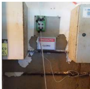
Foto 9 - Detalhe da bomba dosadora de cloro.
