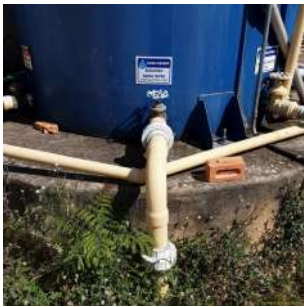
Foto 10 - Tubulação de saída para distribuição.
