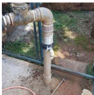
Foto 4 - Torneira para coleta de água bruta.
