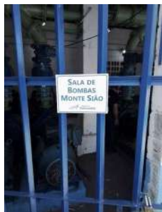
Foto 1 - Identificação da casa de bombas.
