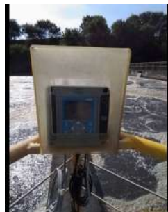
Foto 3 - Medidor de oxigênio dissolvido em um dos tanques.
