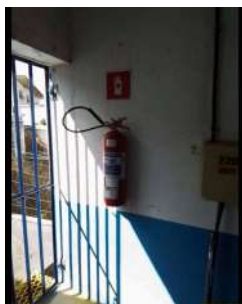
Foto 1 - Extintor na casa de bombas.
