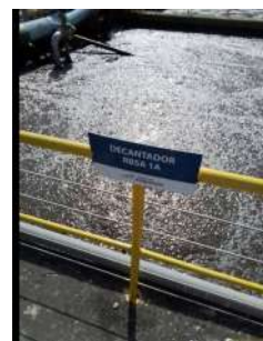
Foto 13 - Um dos tanques da ETE funcionando com aerador.
