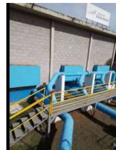
Foto 6 - Tubulação dos sopradores para aeração
