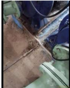
Foto 3 - Drenagem da água de lubrificação das gaxetas.
