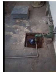
Foto 2 - Caixa para coletar a água de lubrificação e bomba para recalcar a água acumulada.
