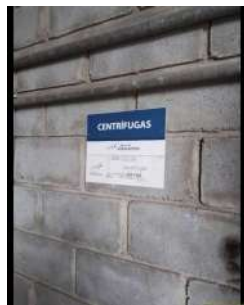
Foto 1 - Centrífugas do tratamento de lodo.
