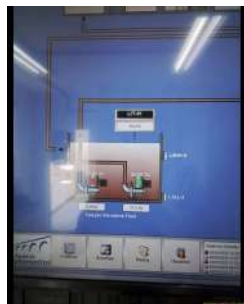
Foto 1 - Monitoramento das duas bombas instaladas na elevatória.
