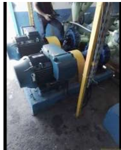
Foto 1 - Duas bombas instaladas.
