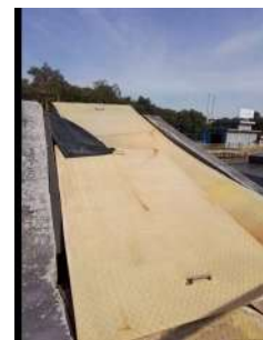
Foto 4 - Calha parshall situada abaixo da tampa exibida na foto.
