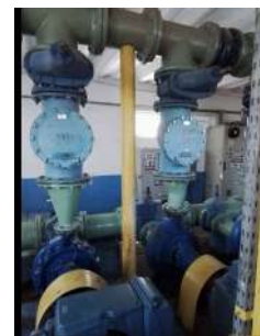
Foto 2 - Duas bombas instaladas na elevatória Rio Acima.
