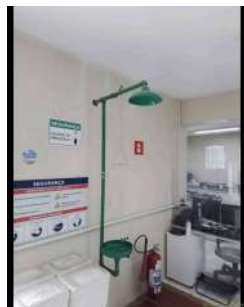
Foto 1 - Chuveiro de emergência no laboratório.
