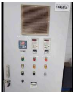
Foto 1 - Identificação do painel de comando. Solicita-se que sejam identificados os conjuntos motobomba com TAG ou placa.
