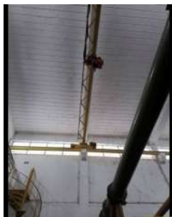
Foto 1 - Ponte rolante para içamento de bombas e motores.
