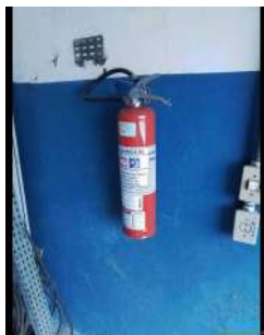
Foto 1 - Extintor na elevatória.
