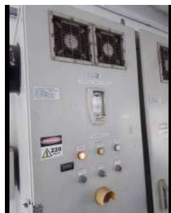
Foto 3 - Painel de comando das bombas.
