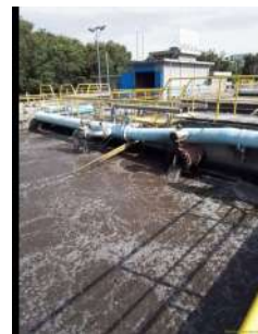
Foto 11 - Entrada de efluente em um dos tanques, após tratamento preliminar.
