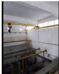
Foto 1 - Ponte rolante para içamento dos equipamentos e escada para acessar a elevatória.
