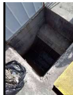
Foto 26 - Gradeamento no tratamento preliminar.
