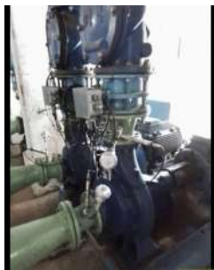
Foto 4 - Sensores instalados na tubulação de recalque.
