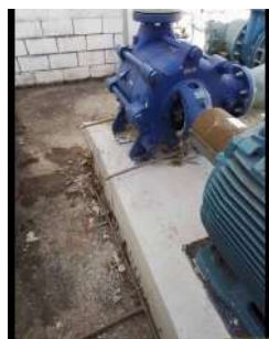
Foto 1 - Tubulação para drenagem de água de lubrificação das bombas da elevatória Vila Irineu.
