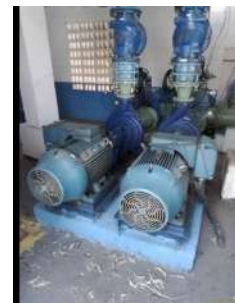
Foto 2 - Duas bombas instaladas.
