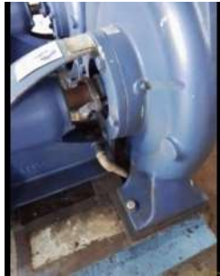
Foto 1 - Tubulação para drenagem da água de lubrificação.
