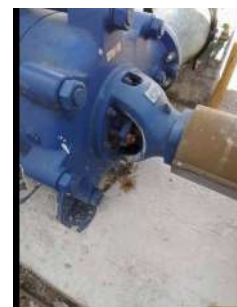
Foto 2 - Tubulação para drenagem de água de lubrificação das bombas da elevatória Vila Irineu.
