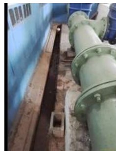
Foto 2 - Canaleta que coleta a água drenada.
