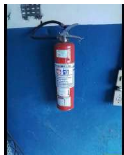
Foto 1 - Extintor na elevatória.
