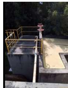
Foto 22 - Caixa de gordura da ETE.
