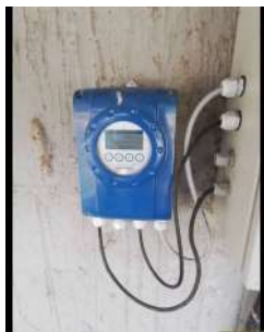
Foto 1 - Visor do medidor de vazão na entrada da ETE.
