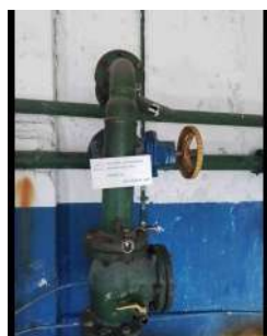
Foto 1 - Identificação da bomba de retrolavagem.
