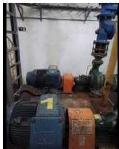
Foto 1 - Duas bombas instaladas.
