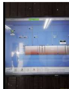
Foto 15 - Sistema que possibilita monitorar a operação da ETE.
