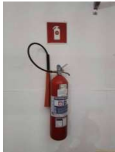
Foto 1 - Extintor na elevatória.
