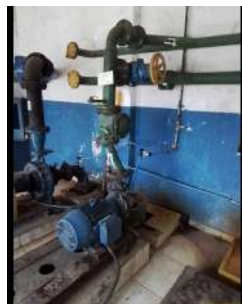
Foto 1 - Apenas uma bomba instalada. De acordo com o funcionário, a outra fica no almoxarifado.
