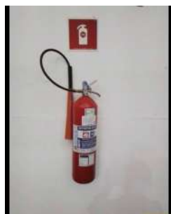
Foto 1 - Extintor na elevatória.
