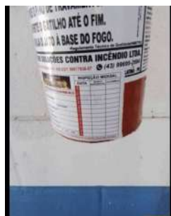
Foto 1 - Validade do extintor.
