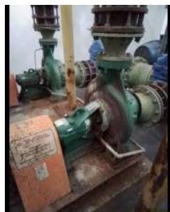
Foto 3 - Tubulação para coletar água de lubrificação das gaxetas.
