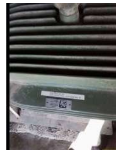
Foto 2 - Identificação da bomba.
