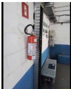
Foto 1 - Extintor na elevatória.
