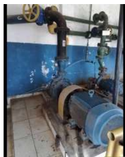
Foto 3 - Uma das bombas da elevatória ETA Votex - Santo Antônio.
