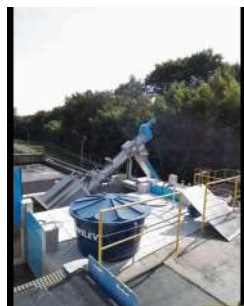
Foto 23 - Peneiramento secundário que entrará em operação com o objetivo de reduzir a presença de sólidos nos tanques.
