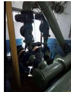
Foto 2 - Duas bombas instaladas.
