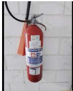
Foto 3 - Extintor na elevatória.
