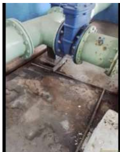
Foto 1 - Tubulação para drenar a água de lubrificação das gaxetas.
