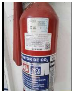
Foto 1 - Validade do extintor.
