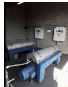
Foto 2 - Centrífugas do tratamento de lodo.
