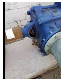
Foto 4 - Tubulação para drenagem de água de lubrificação das bombas da elevatória Vila Irineu.
