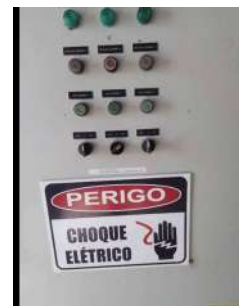
Foto 2 - Painel de comando das bombas.
