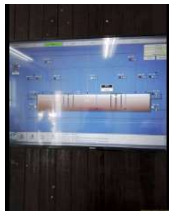
Foto 16 - No sistema, verifica-se o status de cada tanque, por exemplo se está funcionando como decantador ou como aerador.
