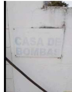
Foto 2 - Identificação da casa de bombas.
