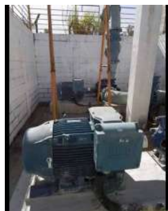
Foto 1 - Duas bombas instaladas na elevatória ETA Central - Vila Irineu.
