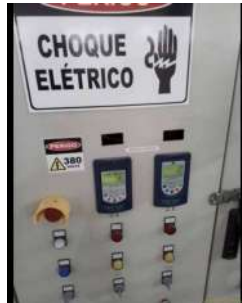
Foto 1 - Identificação do painel de comando das bombas que recalcam para o centro de reservação Itapeva.
