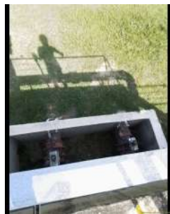
Foto 10 - Tubulação para saída do lodo.
