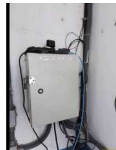
Foto 2 - Macromedidor do recalque para Pq. Bela Vista.
