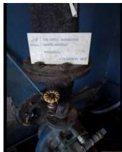
Foto 1 - Identificação em uma das bombas.
