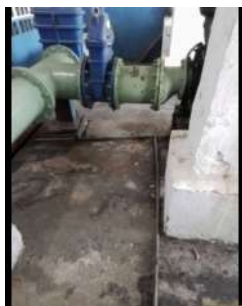
Foto 3 - Tubulação para drenar a água de lubrificação das gaxetas.
