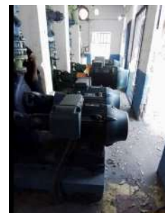
Foto 4 - Duas bombas instaladas.
