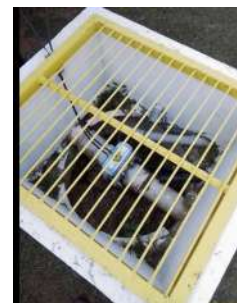
Foto 6 - Tubulação de lodo.
