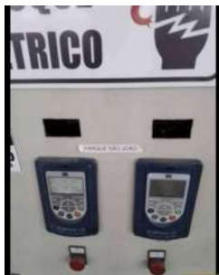
Foto 1 - Identificação do painel de comando das bombas Pq. São João.
