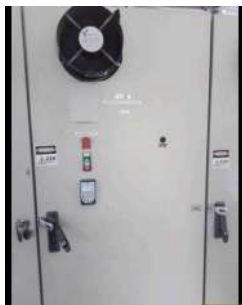
Foto 4 - Pannel de comando da elevatória que abastece o centro de reservação Rio Acima.
