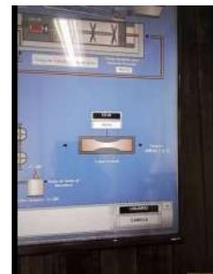
Foto 2 - Visualização da vazão na calha parshall da entrada.
