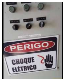
Foto 1 - Painel de comando das bombas de retrolavagem dos filtros da EAT Votex.
