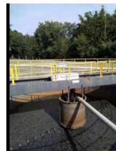
Foto 10 - Tanque para acumulação de lodo.
