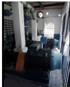
Foto 3 - Interior da elevatória.
