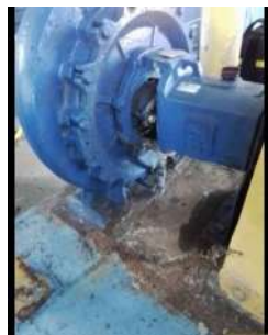
Foto 1 - Tubulação para coletar água de lubrificação das gaxetas.
