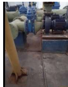
Foto 2 - Tubulação para coletar água de lubrificação das gaxetas.
