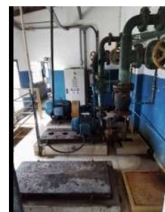
Foto 3 - Uma das bombas de retrolavagem dos filtros.
