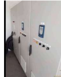
Foto 2 - Painel de comando.
