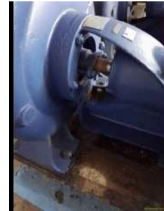
Foto 4 - Drenagem da água de lubrificação das gaxetas.
