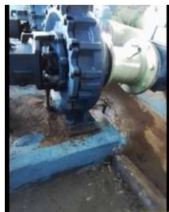
Foto 3 - Tubulação para coletar água de lubrificação das gaxetas.
