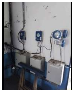
Foto 1 - Medidor de vazão dos recalques.
