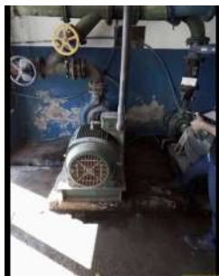
Foto 3 - Bomba da elevatória.
