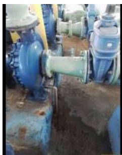
Foto 5 - Tubulação para drenagem de água de lubrificação das bombas da elevatória Rio Acima.
