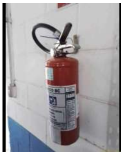
Foto 1 - Extintor na elevatória.
