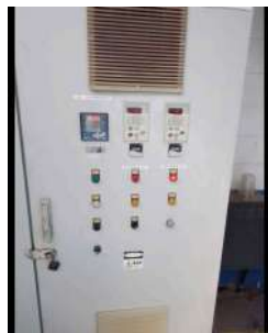
Foto 1 - Painel de comando das bombas.
