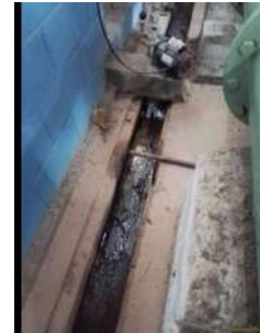
Foto 2 - Drenagem da água de lubrificação das gaxetas.
