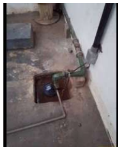
Foto 1 - Caixa coletora da água drenada.
