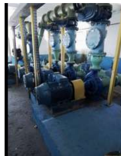
Foto 5 - Bombas da elevatória ETA Central - Rio Acima
