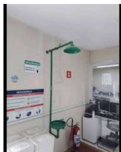
Foto 1 - Chuveiro de emergência no laboratório.
