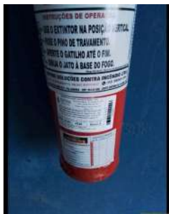
Foto 1 - Validade do extintor.
