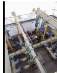
Foto 2 - Visão geral dos sistemas de bombeamento.
