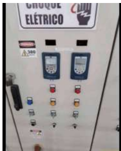
Foto 1 - Duas bombas da elevatória.
