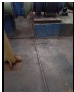
Foto 1 - Tubulação para drenar a água de lubrificação de gaxetas das bombas.
