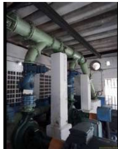
Foto 1 - Tubulação de racalque da elevatória.
