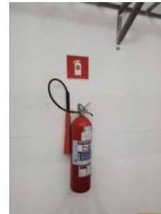
Foto 2 - Extintor na elevatória.
