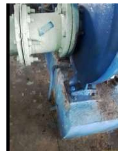
Foto 4 - Tubulação para coletar água de lubrificação das gaxetas.
