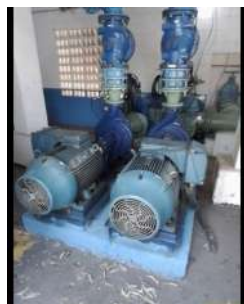
Foto 3 - Duas bombas instaladas.
