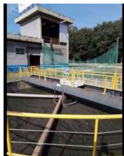
Foto 9 - Tanque para acumulação de lodo.
