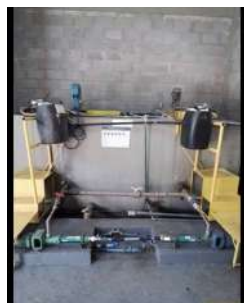
Foto 5 - Adição de polímero para tratamento do lodo.
