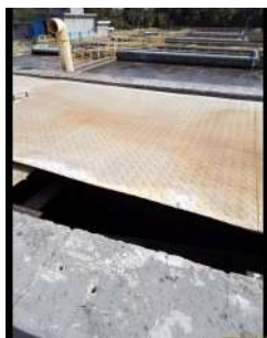
Foto 3 - Calha parshall situada abaixo da tampa exibida na foto.
