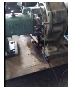
Foto 2 - Tubulação para drenar a água de lubrificação de gaxetas das bombas.
