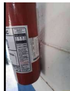
Foto 2 - Validade do extintor.
