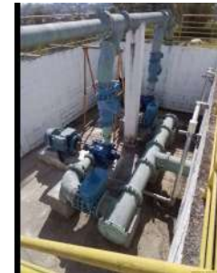
Foto 3 - Visão da elevatória ETA Central - Vila Irineu.
