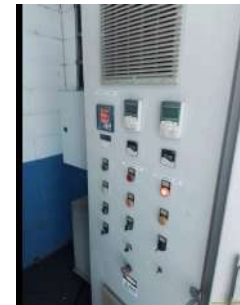
Foto 2 - Painel de comando das bombas.
