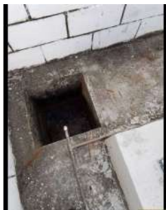
Foto 3 - Caixa coletora da água de lubrificação.
