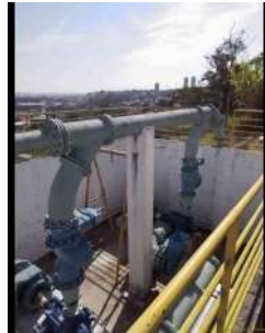
Foto 1 - Bombas que abastecem o centro de reservação Vila Irineu. Antes instaladas na casa de bombas Bela Vista, foram realocadas para essa área externa.
