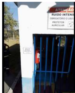
Foto 1 - Placa de identificação da casa de bombas.
