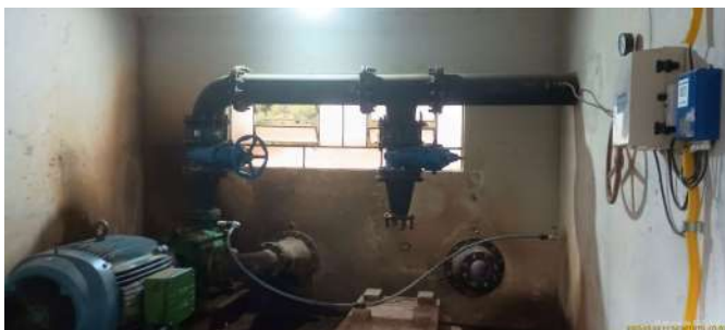
Foto 7 - Vista interna da EEAB.
