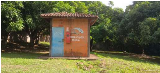
Foto 1 - Vista geral do abrigo do Poço 4, próximo à captação superficial Braiaia.
