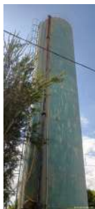
Foto 7 - Vista geral do reservatório e das tubulações de chegada.
