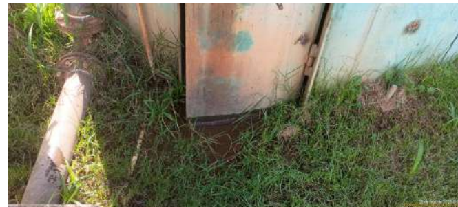
Foto 3 - Situação do terreno no lado externo do reservatório, em razão dos vazamentos.
