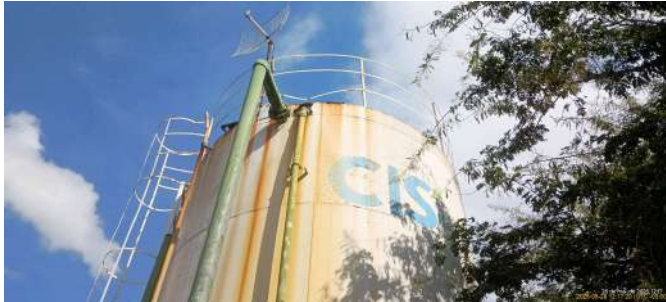
Foto 1 - Situação da cobertura do reservatório, com sinais de oxidação e corrosão.
