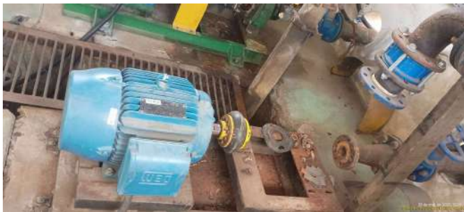
Foto 5 - Conjunto motobomba 01, sem bomba instalada.
