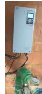
Foto 3 - Painel elétrico do poço.
