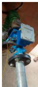
Foto 4 - Macromedidor no cavalete do poço.
