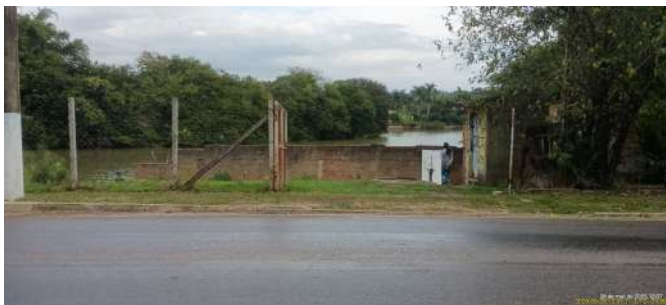
Foto 1 - Ausência de portão na entrada da área.
