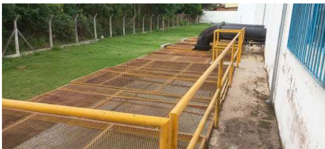
Foto 7 - Tanque de sucção da EEAB.
