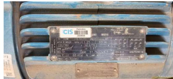
Foto 6 - Placa de especificações técnicas do motor do conjunto 1.
