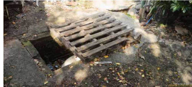
Foto 2 - Fechamento inadequado da caixa de registros no local.
