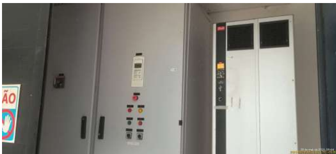
Foto 9 - Painéis elétricos e de comando da EEAB.
