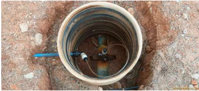
Foto 7 - Local de dosagem de hipoclorito para desinfecção.
