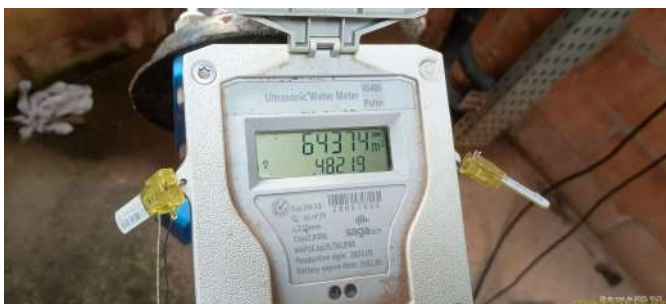
Foto 5 - Macromedidor do poço.
