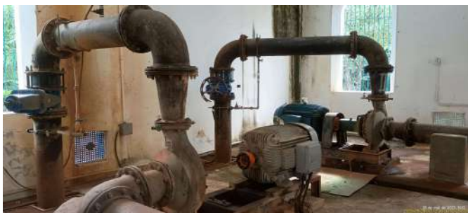
Foto 1 - Ausência de conjunto reserva.
