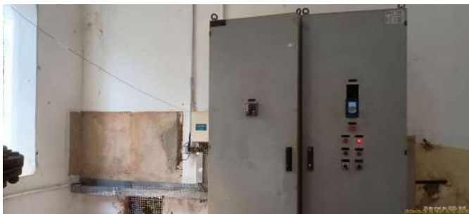
Foto 10 - PAINEL ELÉTRICO E DE COMANDOS DA EEAB.
