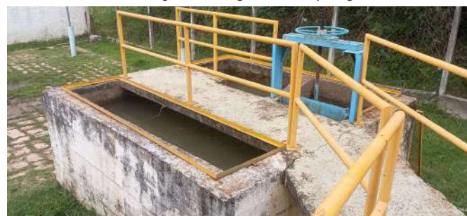
Foto 6 - Tanque de chegada da água bruta.
