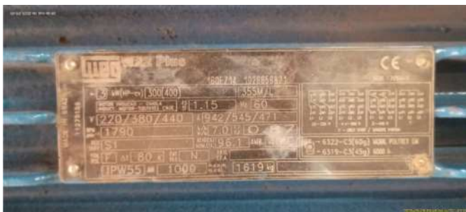
Foto 13 - Placa de especificações técnicas do motor do conjunto motobomba 2.
