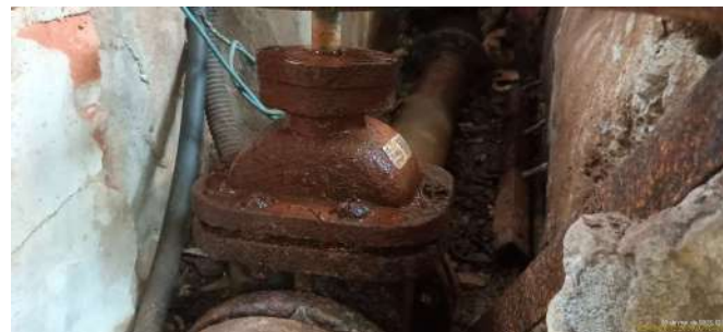
Foto 2 - Detalhe do vazamento no registro.
