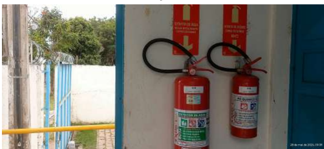
Foto 5 - Extintores de incêndio da EEAB.
