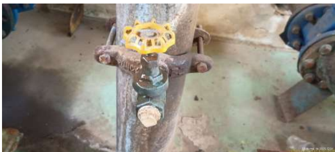
Foto 4 - Detalhe do vazamento na torneira.
