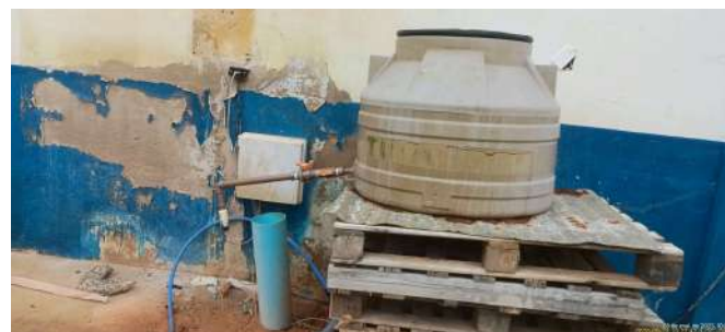
Foto 6 - Tanque de armazenamento de hipoclorito.
