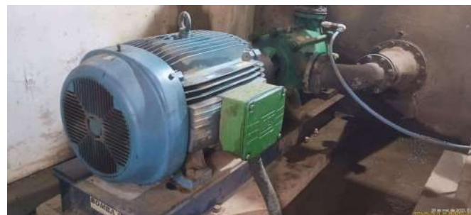
Foto 8 - Único conjunto motobomba instalado no momento da fiscalização.
