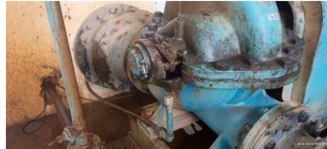
Foto 2 - Detalhe do eixo do conjunto motobomba 1.
