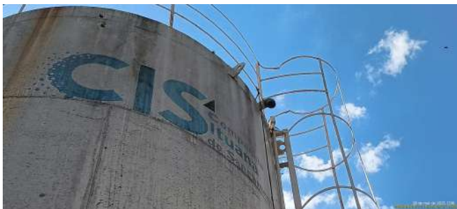
Foto 1 - Ausência de tela de proteção no tubo extravasor.
