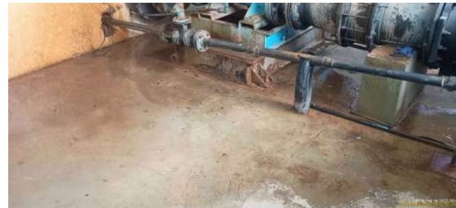
Foto 4 - Situação do piso da casa de bombas, em virtude da drenagem inadequada.
