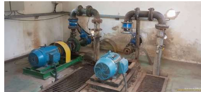
Foto 4 - Conjuntos motobomba da EEAT.
