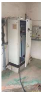
Foto 5 - Cabo elétrico saindo do painel pela porta, impedindo seu fechamento adequado.
