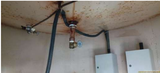
Foto 1 - Vazamento na base do reservatório (vista interna, próximo ao medidor de nível).
