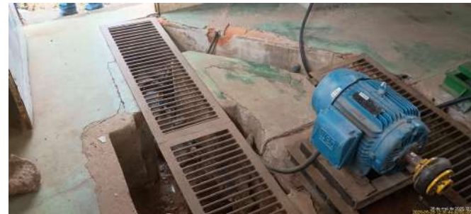
Foto 4 - Situação da base de concreto do conjunto motobomba 1.
