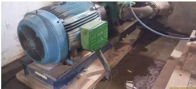
Foto 1 - Situação do piso do interior da casa de bombas.
