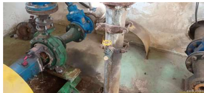
Foto 3 - Localização da torneira na adutora de recalque do conjunto 1.
