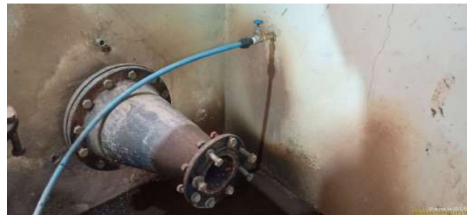
Foto 2 - Torneira da mangueira de escorva da bomba.
