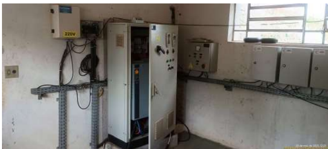
Foto 9 - Painelelétrico e de comando da EEAT.
