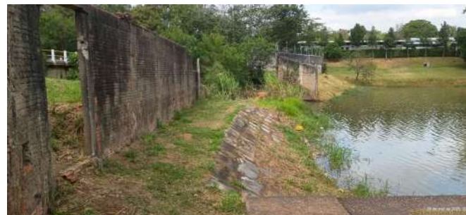
Foto 2 - Ausência de cercamento adequado na parte sob responsabilidade do prestador de serviços.
