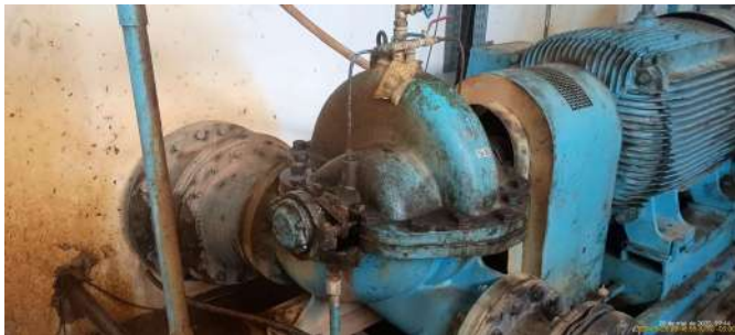
Foto 3 - Detalhe do eixo do conjunto motobomba 1.
