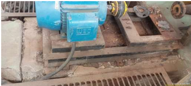
Foto 3 - Situação da base de concreto do conjunto motobomba 1.
