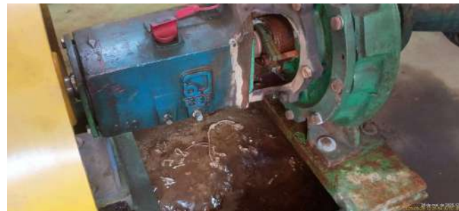
Foto 2 - Ausência de drenagem adequada da água de lubrificação de gaxetas do conjunto 1.
