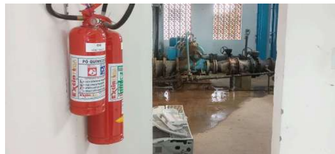
Foto 8 - Extintores de incêndio da EEAB.
