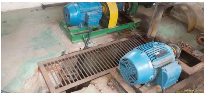
Foto 1 - Localização do registro da adutora de recalque do conjunto 1 (abaixo da grelha no piso).
