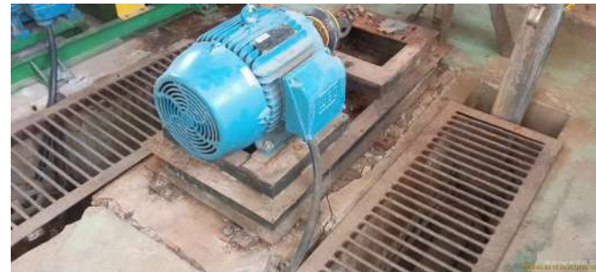
Foto 2 - Situação da base de concreto do conjunto motobomba 1.
