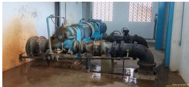
Foto 10 - Conjuntos motobomba (1+1R) da EEAB.
