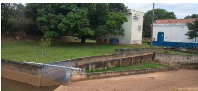
Foto 1 - AUSÊNCIA DE GUARDA-CORPO OU OUTRA FORMA DE PROTEÇÃO NAS ALTERAIS DO CANAL DE DERIVAÇÃO DE ÁGUA BRUTA.
