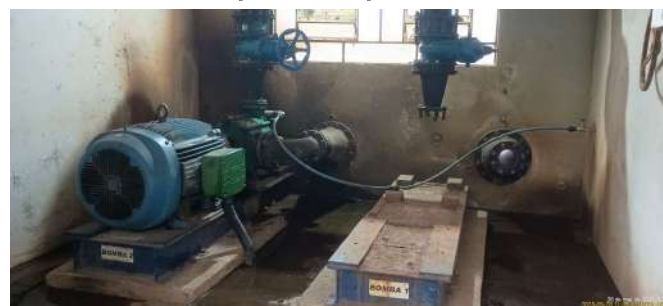
Foto 6 - Vista interna da EEAB.
