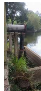
Foto 4 - Tubulações de sucção da casa de bombas.
