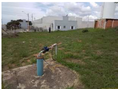
Foto 7 - Vista geral do local onde se situa o poço.
