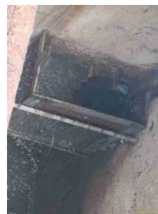
Foto 4 - Gradeamento grosseiro (cesto).
