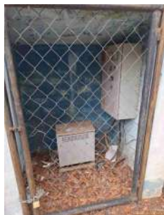
Foto 7 - Pannel de controle.
