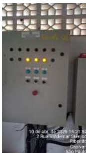
Foto 9 - Painel de controle.
