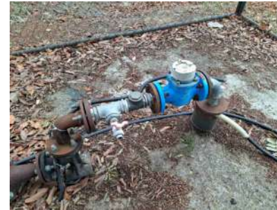
Foto 4 - Cavalete do poço.
