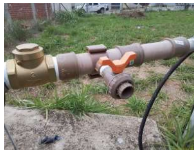
Foto 6 - Torneira para tomada de água bruta.
