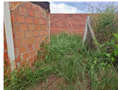
Foto 2 - Mato alto na lateral do reservatório.
