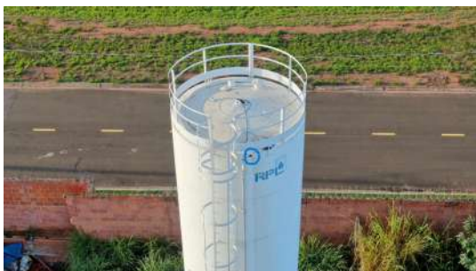
Foto 1 - Extravasador sem tela de proteção
