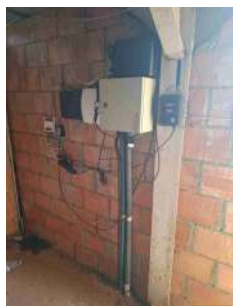
Foto 3 - Controlador e equipamentos de telemetria.
