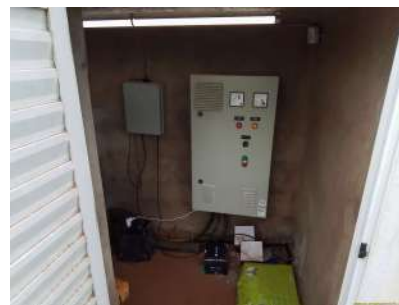
Foto 6 - Painel de comando.
