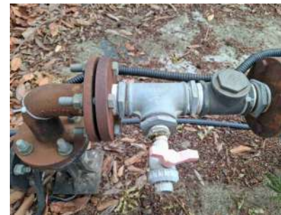
Foto 6 - Torneira para coleta de água bruta.
