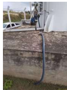
Foto 8 - Aterramento do para-raio.
