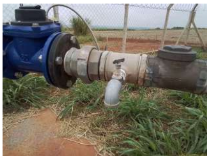
Foto 5 - Torneira para coleta de água bruta.
