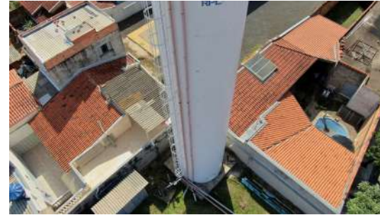
Foto 2 - Tubulações e escada marinheiro.
