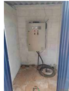
Foto 4 - Paineil de controle.
