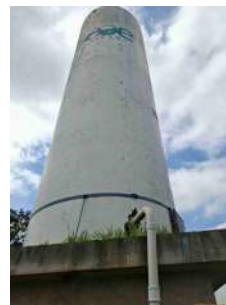
Foto 8 - Tubulação de saída do reservatório.
