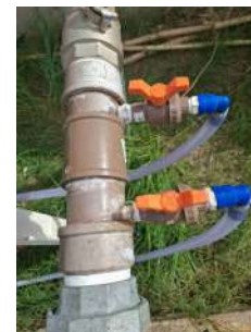
Foto 3 - Vazamento nas roscas.
