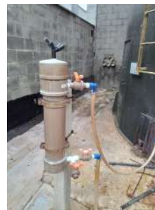
Foto 8 - A dosagem de cloro e flúor é realizada no reservatório Vivva.
