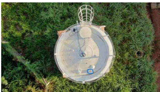
Foto 3 - Tubulação de Ventilação sem a cobertura.
