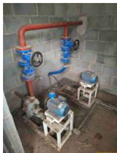
Foto 5 - Casa de bombas. As bombas instaladas não funcionam, o recalque está sendo realizado por meio de bomba submersa.
