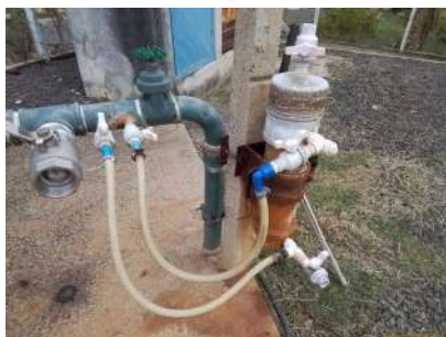
Foto 3 - Dosadora de cloro e flúor em pastilha e tomada de água bruta.
