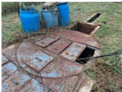
Foto 3 - Poço de sucção com tampas oxidadas e sem fechamento.
