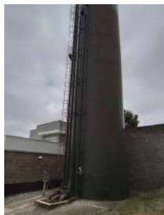
Foto 9 - Vista detalhada do reservatório.
