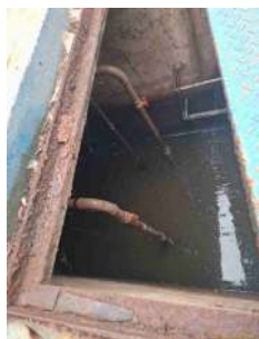
Foto 5 - Poço de sucção com duas bombas.
