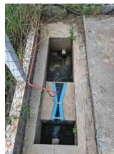
Foto 6 - Calha Parshall localizada na saída do efluente.
