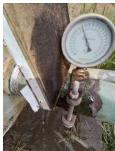
Foto 1 - Vazamento na tubulação do reservatório, na derivação onde está instalado o manômetro.
