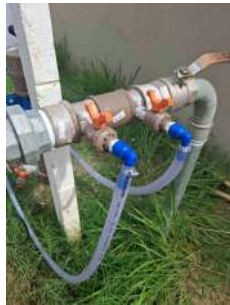
Foto 1 - Vazamento nas roscas da derivação da dosadora de pastilha de cloro.
