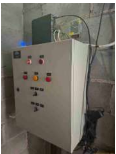
Foto 6 - Painel de controle.
