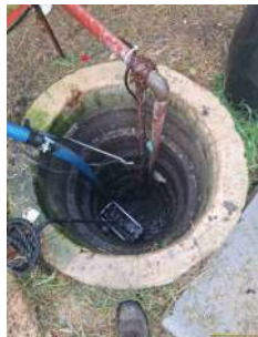
Foto 3 - Poço de sucção com cesto e uma única bomba.
