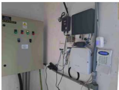
Foto 3 - Painel de controle e sistema de telemetria da EEE.
