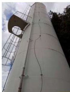
Foto 5 - Cabo de descida do para-raio.
