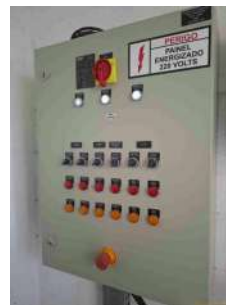
Foto 10 - Painele de Controle.
