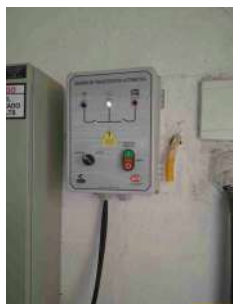
Foto 11 - Quadro de transferência automática.
