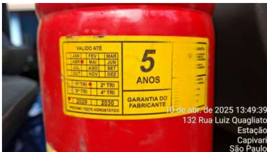
Foto 1 - Validade do extintor de incêndio que fica em caminhão de apoio.
