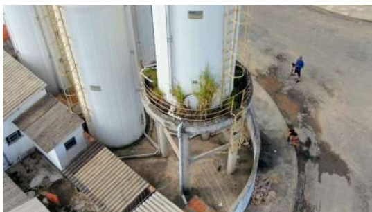
Foto 1 - Vegetação na base do reservatório elevado.
