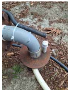
Foto 5 - Tubo de nível do poço.
