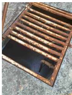
Foto 1 - Grade do poço da elevatória oxidada e apresenta falta de fechamento.
