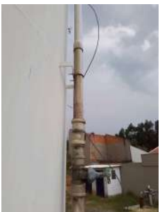
Foto 3 - Vazamento na tubulação do reservatório.
