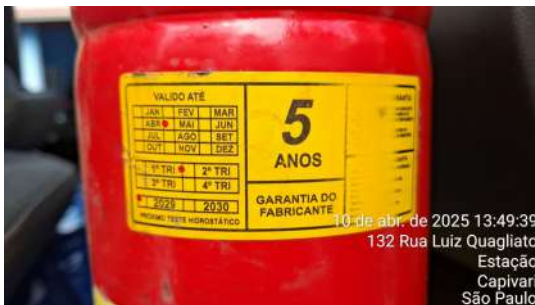
Foto 1 - Validade do extintor de incêndio do caminhão de apoio.
