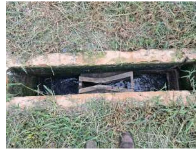
Foto 2 - Calha parshall na entrada do efluente.
