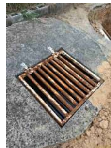
Foto 2 - Grade do poço da elevatória oxidada.
