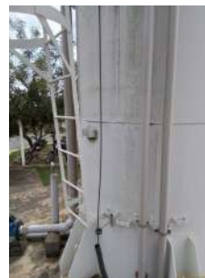
Foto 6 - Cabo de descida do para-raio.
