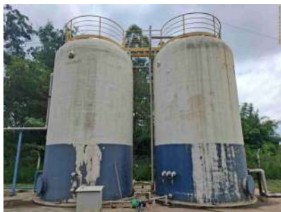
Foto 7 - Reatores UASB, vista lateral.
