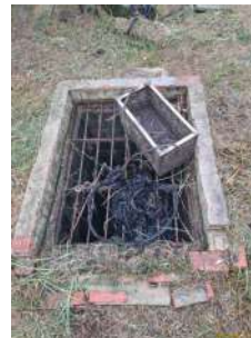
Foto 4 - Caixa de passagem.
