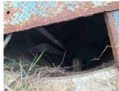
Foto 4 - Poço de sucção com duas bombas.
