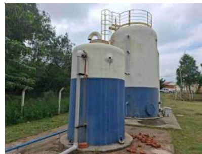
Foto 8 - Reservatório de aeração.
