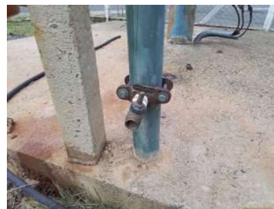
Foto 6 - Torneira para tomada de água tratada.
