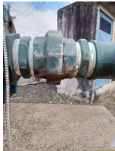
Foto 1 - Gotejamento no cavalete.
