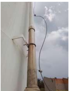
Foto 2 - Detalhe do vazamento na tubulação do reservatório.
