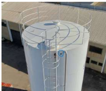
Foto 1 - Saída para tubulação sem tela de proteção.
