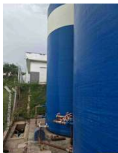
Foto 5 - Tubulações de saída dos reatores UASB.
