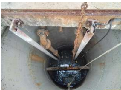
Foto 1 - Apenas um conjunto motobomba (à direita) instalado.
