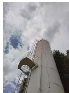
Foto 6 - Tubo extravasor próximo ao topo do reservatório.
