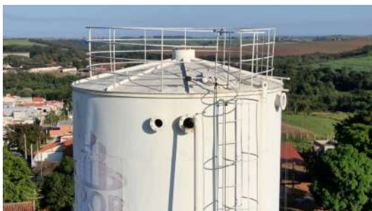
Foto 1 - Saídas para tubulações sem tela de proteção.
