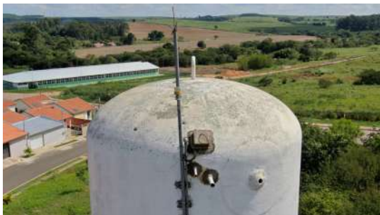
Foto 1 - Tubulações de ventilação e extravasão sem tela de proteção.
