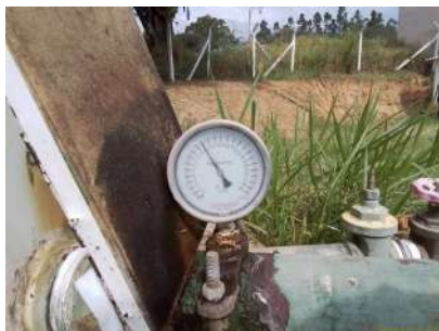
Foto 7 - Medidor de nível.
