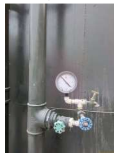
Foto 4 - Medição de nível.
