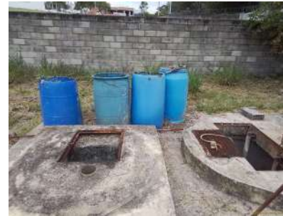
Foto 2 - Ausência de tampa nos poços.
