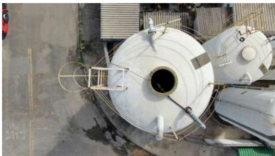
Foto 1 - Reservatório sem tampa de inspeção.
