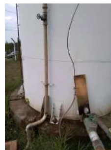
Foto 4 - Aterramento do para-raio.
