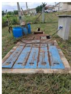
Foto 1 - Tampas do poço de sucção oxidadas.
