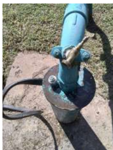
Foto 1 - Tubo para medição do nível.
