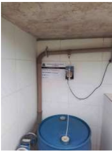
Foto 2 - Armazenamento de flúor.
