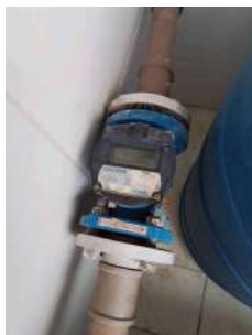
Foto 1 - Macromedidor digital na tubulação de recalque.
