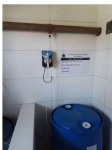
Foto 1 - Armazenamento de cloro.
