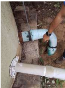
Foto 1 - Neste local havia um vazamento verificado em fiscalização anterior; foi solucionado.
