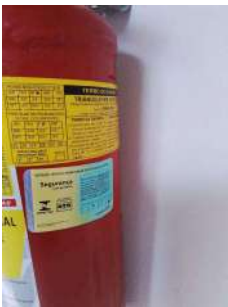
Foto 1 - Manutenção do extintor.
