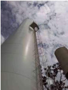
Foto 3 - Reservatório elevado atualmente em operação, abastecido pelos poços 3 e 6.
