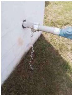
Foto 1 - Torneira para tomada de água bruta.
