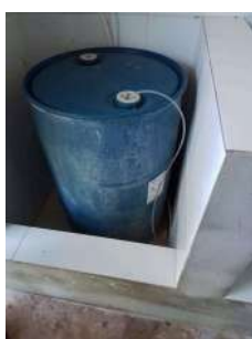
Foto 5 - Bombona para armazenamento de produto químico.
