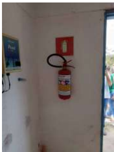
Foto 1 - Extintor do poço.
