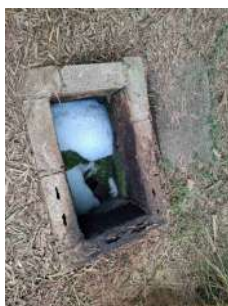
Foto 20 - Saída do efluente
