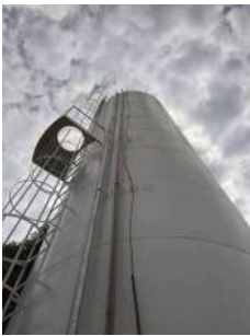
Foto 2 - Descida do aterramento.
