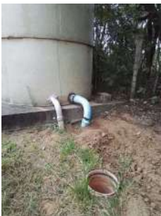
Foto 2 - Local onde havia um vazamento em um dos reservatórios apoiados.
