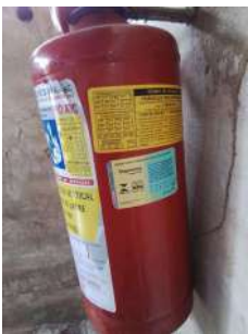
Foto 1 - Manutenção do extintor.
