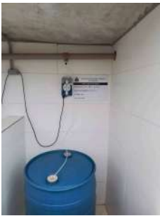
Foto 1 - Armazenamento de cloro.
