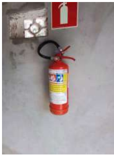
Foto 1 - Extintor junto ao painel de comando da bomba do poço.
