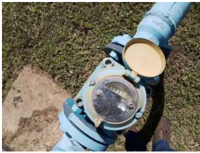
Foto 1 - Macromedidor no cavalete do poço.
