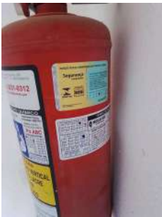
Foto 1 - Manutenção do extintor.
