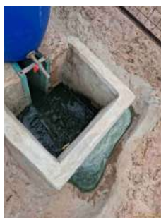
Foto 17 - Efluente após calha parshall da saída e aplicação de produto químico.
