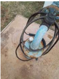
Foto 1 - Tubo para medição do nível.
