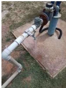
Foto 1 - Torneira para tomada de água bruta.
