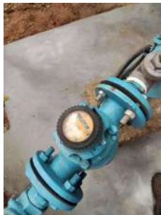
Foto 1 - Macromedidor no cavalete do poço.
