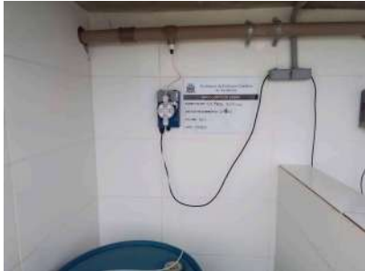
Foto 3 - Dosagem de cloro.
