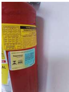
Foto 1 - Manutenção do extintor.
