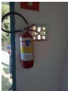
Foto 1 - Extintor do poço.
