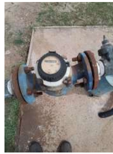
Foto 2 - Macromedidor no cavalete do poço.
