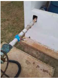
Foto 1 - Torneira para tomada de água bruta.
