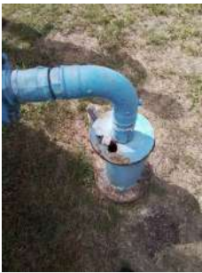
Foto 1 - Tubo de medição de nível.
