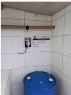
Foto 2 - Armazenamento e dosagem de flúor.
