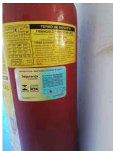
Foto 1 - Manutenção do extintor.
