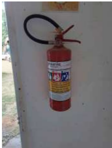
Foto 1 - Extintor de incêndio no poço.
