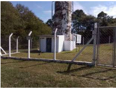
Foto 8 - Abrigo dos produtos químicos, situado junto ao reservatório abastecido pelo poço 2.
