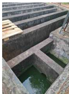
Foto 18 - Saída do tanque de contato.
