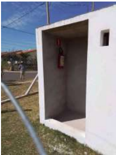
Foto 1 - Extintor de incêndio no poço.
