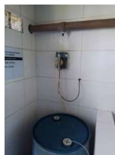
Foto 2 - Bomba dosadora de flúor.
