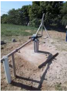
Foto 2 - Macromedidor no cavalete do poço.
