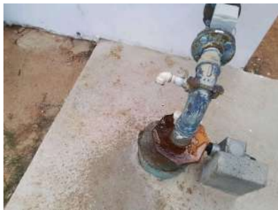
Foto 1 - Torneira para tomada de água bruta.
