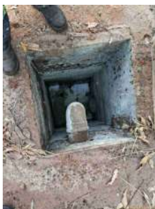
Foto 12 - Saída do efluente da lagoa facultativa.
