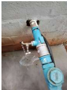
Foto 1 - Torneira para tomada de água bruta.
