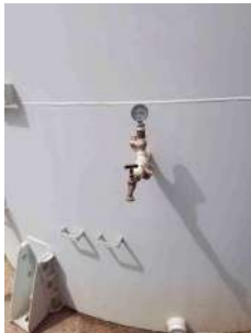
Foto 1 - Manômetro para monitoramento do nível do reservatório.
