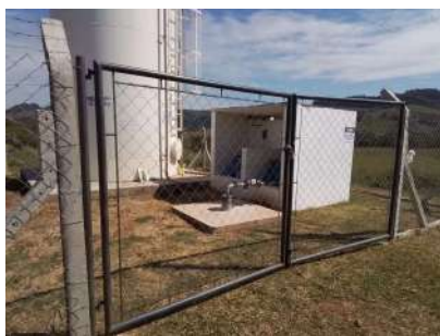
Foto 1 - Bombonas para armazenamento de cloro e flúor.
