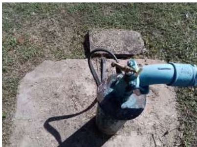
Foto 1 - Torneira para tomada de água bruta.
