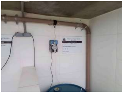
Foto 2 - Dosagem de flúor.
