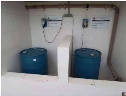
Foto 1 - Bombonas para armazenamento de produtos químicos.
