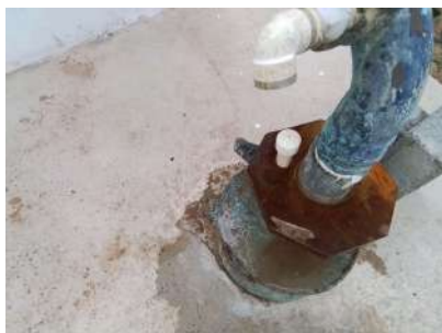
Foto 1 - Tubo de medição de nível.
