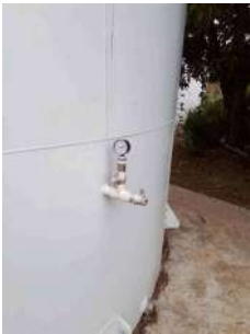
Foto 1 - Manômetro para monitoramento do nível do reservatório.
