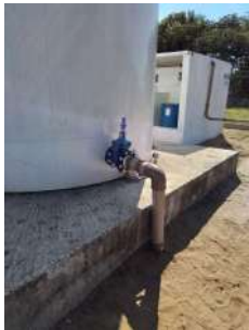
Foto 1 - Manômetro para monitoramento do nível do reservatório.
