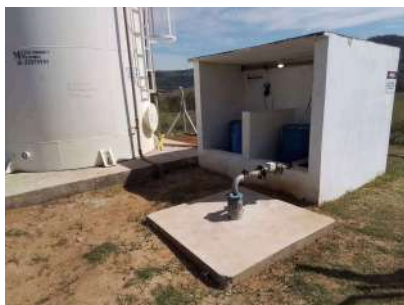
Foto 1 - Macromedidor no cavalete do poço.
