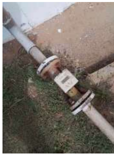
Foto 1 - Macromedidor digital na tubulação de recalque.
