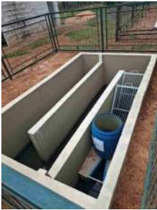
Foto 2 - Calha e gradeamento do tratamento preliminar do efluente proveniente do loteamento Cavalinho.
