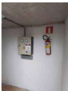
Foto 1 - Extintor junto ao painel de comando do poço.
