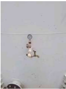
Foto 1 - Manômetro para medição do nível do reservatório.
