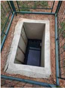
Foto 1 - Entrada de esgoto proveniente do Loteamento Cavalinho.
