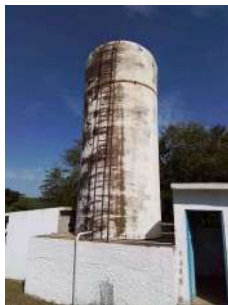
Foto 1 - Reservatório abastecido pelo poço 2. Está prevista a substituição pelo reservatório taça situado na área do poço 6.
