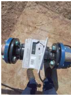
Foto 1 - Macromedidor do poço.
