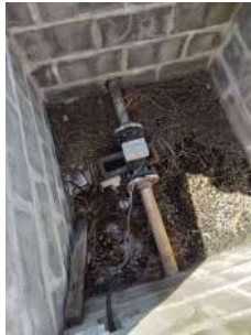
Foto 3 - Macromedidor digital na tubulação de recalque.
