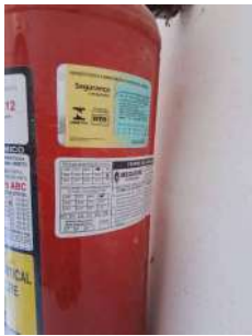
Foto 1 - Manutenção do extintor.
