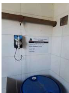
Foto 3 - Armazenamento de cloro.
