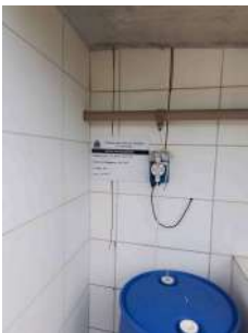
Foto 1 - Armazenamento e dosagem de cloro.
