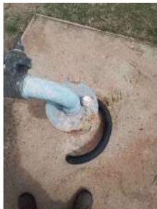
Foto 1 - Tubo para medição do nível.
