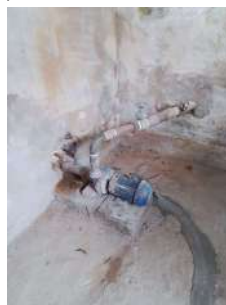
Foto 4 - Bomba da elevatória.
