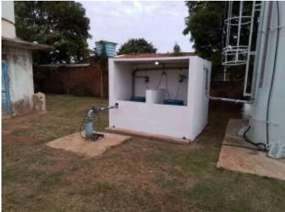
Foto 3 - Abrigo de produtos químicos (cloro e flúor).
