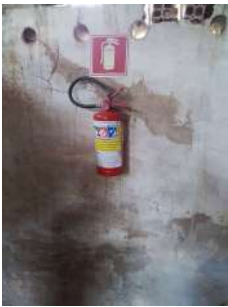
Foto 1 - Extintor de incêndio na elevatória.
