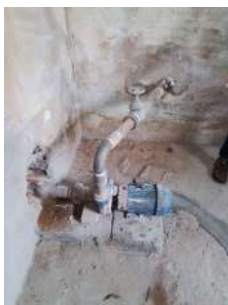
Foto 3 - Bomba da elevatória.
