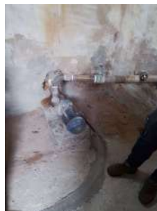
Foto 2 - Bomba da elevatória. Funcionário do DAE informou que há reserva no almoxarifado.
