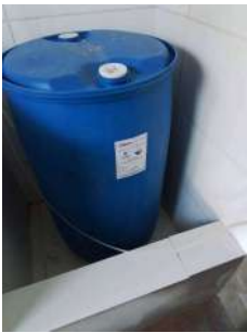
Foto 7 - Bombona para armazenamento de produto químico.
