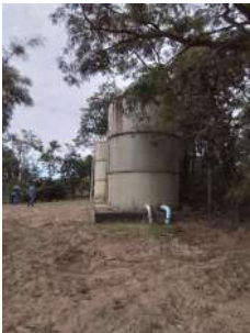
Foto 3 - Reservatórios apoiados do poço 7.
