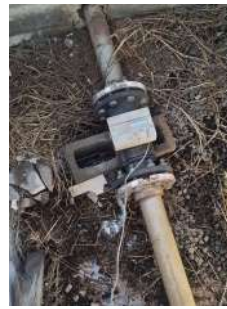
Foto 2 - Macromedidor digital na tubulação de recalque.
