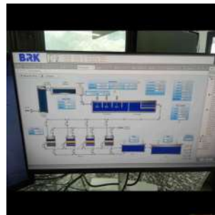
Foto 3 - CCO - Tela ETA Tratamento
