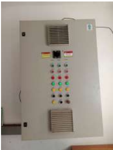
Foto 3 - Painel de comando e controle
