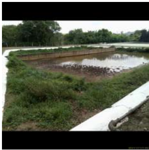
Foto 1 - Vista das lagoas inoperantes
