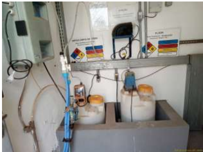
Foto 2 - Armazenamento e dosagem de cloro e flúor
