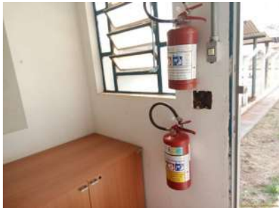
Foto 4 - Extintor de incêndio
