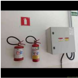
Foto 2 - Extintor de incêndio
