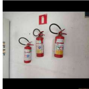
Foto 5 - Extintor de incêndio
