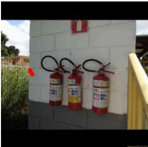
Foto 3 - Extintor de incêndio
