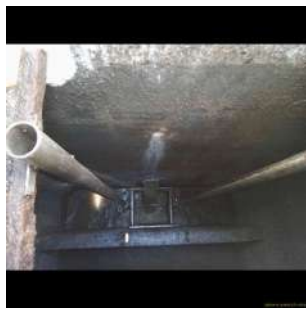
Foto 4 - Vista do interior do poço do sucção e cesto
