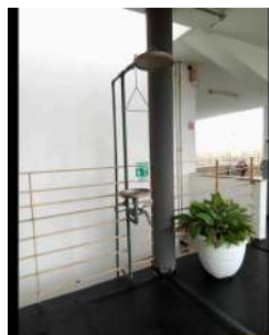
Foto 11 - Chuveiro de emergência
