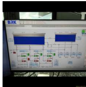
Foto 2 - CCO - Tela medição vazão saída ETA
