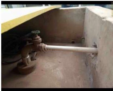
Foto 9 - Laje de proteção e tubo de medição de nível
