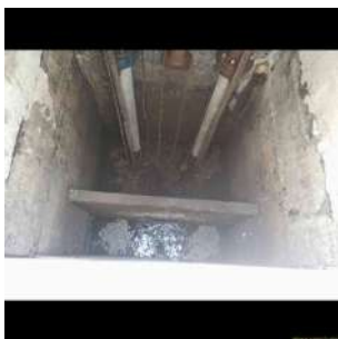
Foto 1 - Ausência de gradeamento
