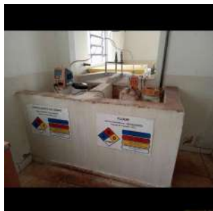
Foto 9 - Armazenamento e dosagem de cloro e flúor
