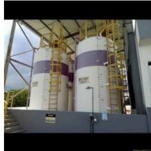
Foto 20 - Sistema de desinfecção com hipoclorito de sódio
