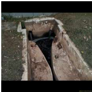
Foto 2 - Calha Parshall e chegada do esgoto bruto
