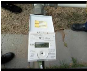
Foto 8 - Macromedidor de vazão do poço
