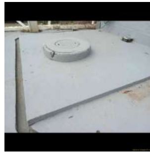
Foto 4 - Poço de sucção
