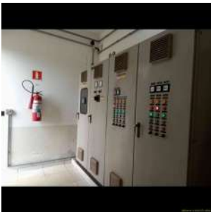
Foto 3 - Painel de comando e controle
