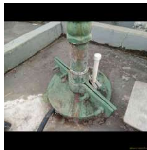
Foto 6 - Tubo de medição de nível
