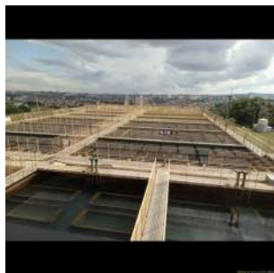
Foto 4 - Visão geral da ETA
