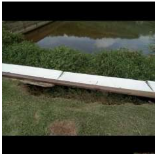
Foto 3 - Erosão na crista de proteção do talude
