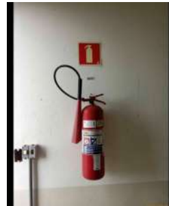
Foto 8 - Extintor de incêndio
