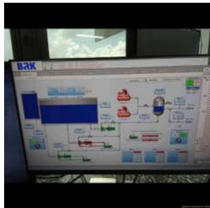
Foto 1 - CCO - Tela medição de vazão entrada ETA
