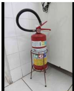
Foto 10 - Extintor de incêndio
