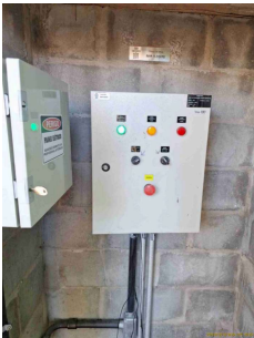
Foto 2 - Pannel elétrico - interior do abrigo - EEE Corumbataí VI
