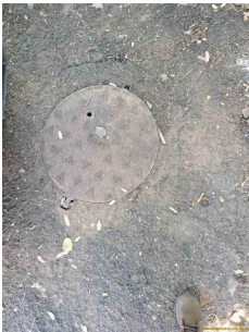
Foto 2 - Poço de Sução em via pública
