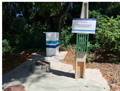
Foto 5 - Poço de sucção e abrigo do painel elétrico
