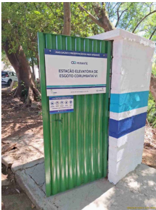
Foto 1 - Identificação - EEE Corumbataí VI
