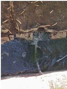
Foto 6 - ETE São Jorge - saída do tratamento - medidor afogado
