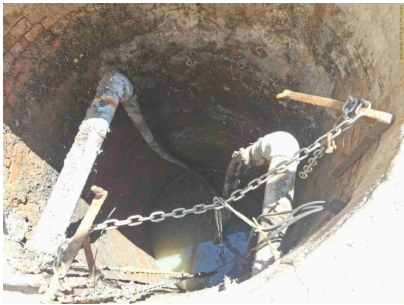
Foto 1 - Poço de Sucção com um conjunto moto bomba instalado
