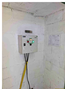
Foto 4 - Painel elétrico - EEE Guamium IV
