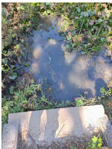
Foto 3 - Entrada de esgoto - ETE São Jorge
