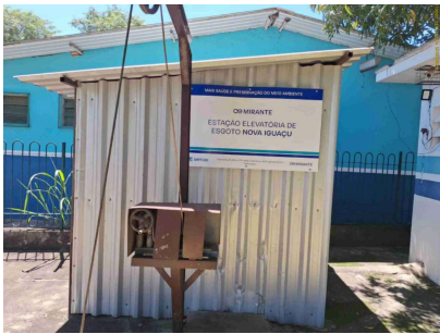
Foto 3 - Identificação - EEE Nova Iguaçu
