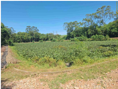
Foto 5 - ETE São Jorge - lagoa facultativa - visão geral - aguapés na lagoa
