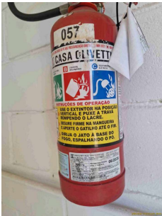
Foto 4 - Extintor de incêndio com validade regular - EEE Vila Verde
