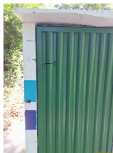
Foto 2 - Portão do abrigo do painel elétrico - EEE Guamium IV
