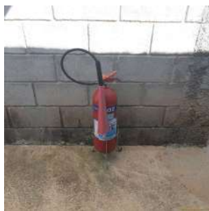
Foto 26 - Extintor de incêndio instalado próximo ao abrigo dos painéis.
