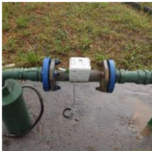
Foto 5 - Macromedidor de vazão.
