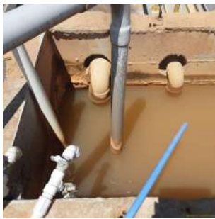
Foto 7 - Ponto de entrada da água bruta e aplicação de produtos químicos do tratamento.
