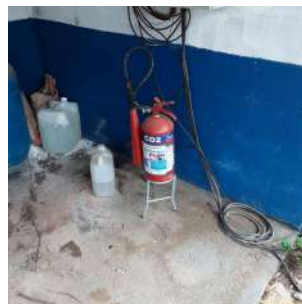
Foto 12 - Extintor de incêndio instalado próximo aos painéis elétricos.
