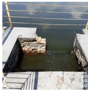
Foto 9 - Ponto de saída do efluente tratado. O efluente tratado não recebe nenhum tipo de desinfecção antes do lançamento final.
