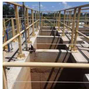
Foto 21 - Filtros do módulo 4.
