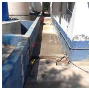
Foto 5 - Lateral dos diques de contenção. As setas vermelhas indicam os orifícios de saída onde ainda não foram instalados registros para controle do escoamento de líquidos acumulados dentro dos diques. A seta amarela indica um registro existente em ponto anterior aos diques.
