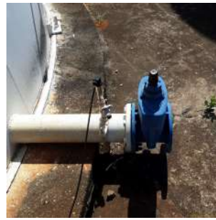
Foto 11 - Detalhe do equipamento de telemetria instalado na base do reservatório.
