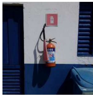
Foto 23 - Extintor de incêndio instalado na parede externa da edificação.
