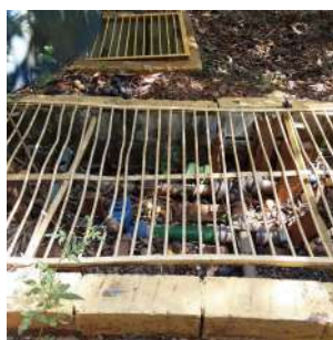
Foto 10 - Caixa de registros de manobras da tubulação que sai do poço e vai para o reservatório.
