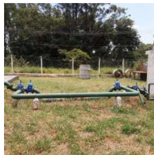
Foto 13 - Tubulação de saída do reservatório.
