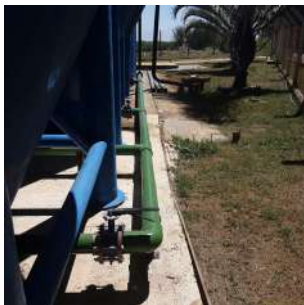
Foto 12 - Tubulação de saída do lodo decantado.
