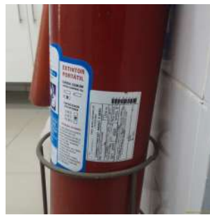
Foto 35 - Detalhe da etiqueta de controle de manutenções do extintor - dentro da validade.
