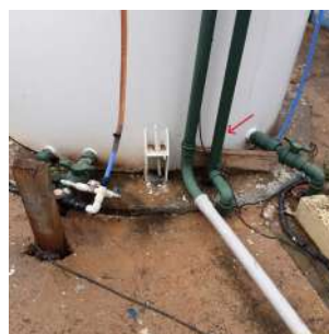
Foto 6 - Detalhe das tubulações de entrada e saída de água do reservatório. A seta vermelha indica o tubo extravasor.
