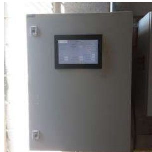
Foto 23 - Pannel de controle operacional.
