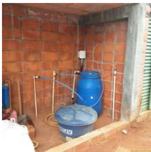
Foto 11 - Tanques de armazenamento de cloro e flúor.
