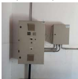
Foto 13 - Detalhe dos painéis elétricos.
