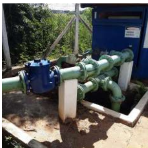
Foto 6 - Vista geral da tubulação da elevatória.
