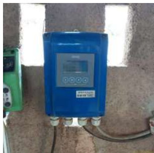
Foto 7 - Tela do medidor de vazão.
