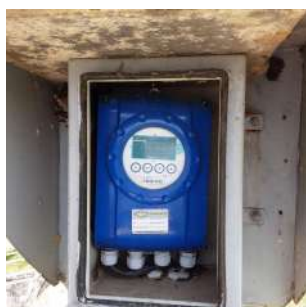
Foto 20 - Tela do macromedidor de entrada do efluente bruto.
