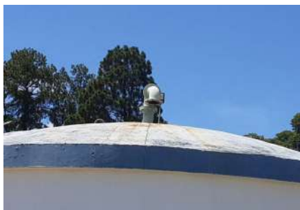
Foto 1 - Tubo de ventilação do reservatório menor - sem tela de proteção.
