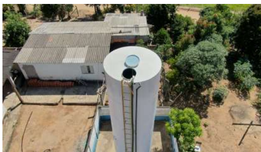
Foto 2 - Topo do reservatório sem guarda-corpos.
