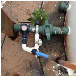
Foto 10 - Equipamento de telemetria instalado junto à base do reservatório.
