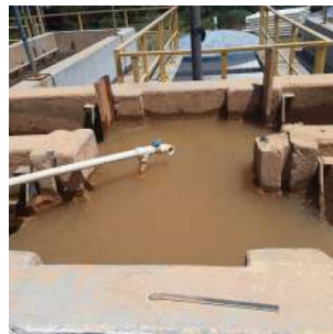
Foto 9 - Caixa de distribuição da água para os quatro módulos.
