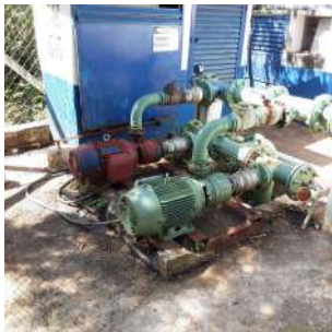
Foto 3 - Vista geral da elevatória. Há dois conjuntos moto-bomba instalados, um em funcionamento e o segundo como reserva.
