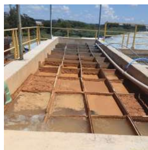
Foto 13 - Floculador do módulo 2.
