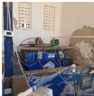
Foto 7 - Tanque e bomba dosadora de cloro.
