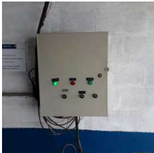
Foto 7 - Painel elétrico da elevatória.
