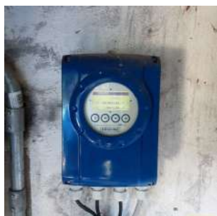
Foto 7 - Detalhe do medidor de vazão da água bombeada pela elevatória.
