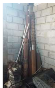
Foto 15 - Bombas reserva de poço armazenadas no almoxarifado.
