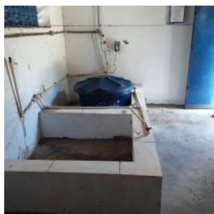
Foto 14 - Diques de contenção dos tanques de produtos químicos, o dique que seria do tanque de flúor está vazio.
