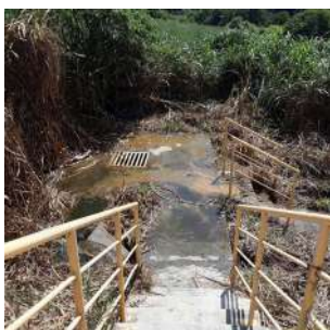
Foto 1 - Ponto com vazamento de efluente tratado.
