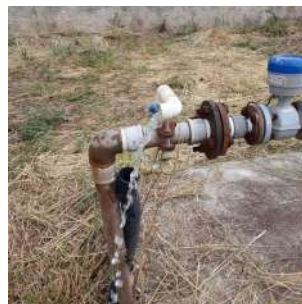
Foto 8 - Torneira para coleta de água bruta.
