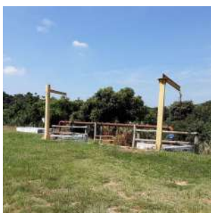
Foto 12 - Vista geral da estação elevatória que recebe o efluente bruto e o recalca para o tratamento nas lagoas.
