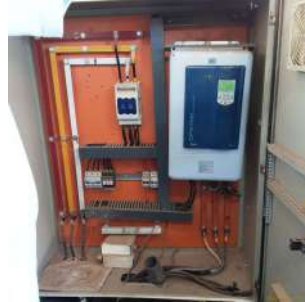
Foto 10 - Detalhe do painel elétrico e medidor de vazão.
