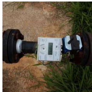
Foto 6 - Detalhe da tela do macromedidor de vazão.
