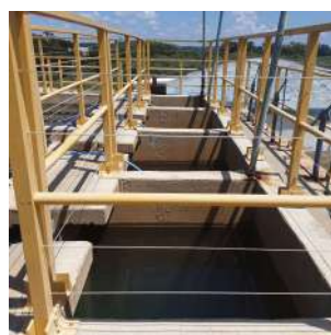
Foto 15 - Filtros do módulo 2.
