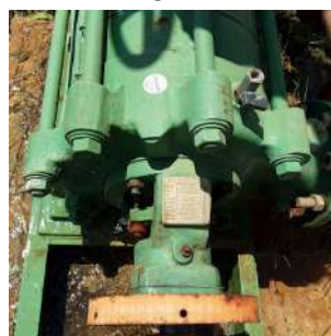
Foto 5 - Etiqueta de identificação da bomba 1.
