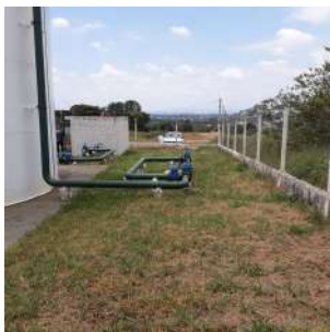
Foto 12 - Tubulação de chegada da água no reservatório.
