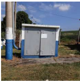
Foto 22 - Painel elétrico próximo à edificação.
