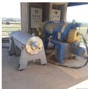
Foto 6 - Centrífugas de desidratação do lodo. A centrífuga da esquerda foi adquirida recentemente.
