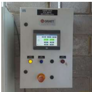
Foto 24 - Pannel de controle operacional.
