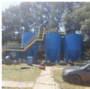
Foto 8 - Vista geral do tanque de homogeneização e dos tanques decantadores do tipo Dortmund.
