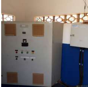
Foto 9 - Painéis elétricos instalados no interior da edificação.
