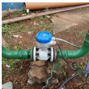
Foto 6 - Macromedidor de vazão.
