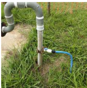
Foto 7 - Ponto de tomada de água bruta após passagem da água pelo macromedidor.
