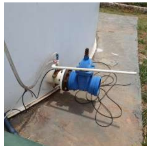
Foto 14 - Mangueira de medição de nível.
