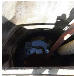
Foto 16 - Vista do interior do poço de bombeamento em uso.
