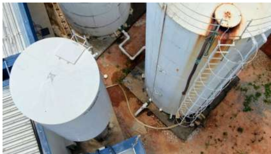
Foto 16 - Detalhe da mangueira de medição de nível.
