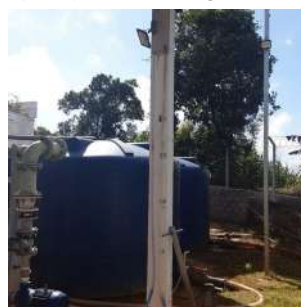
Foto 8 - Medidor de nível do reservatório.
