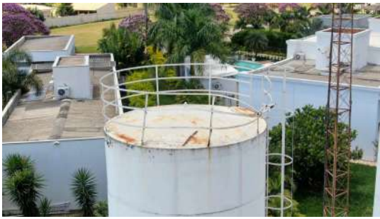
Foto 1 - Detalhe do guarda-corpos danificado no topo do Reservatório 1.
