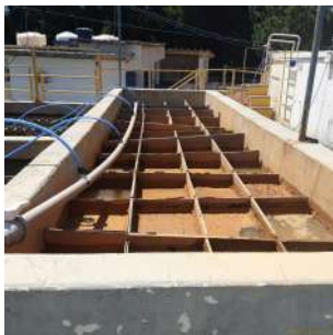
Foto 10 - Floculador do módulo 1.
