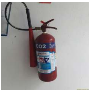
Foto 11 - Extintor de incêndio instalado no interior da edificação.
