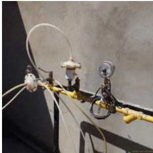
Foto 12 - Detalhe do manômetro.
