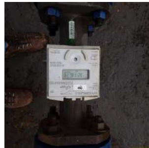
Foto 6 - Detalhe da tela do macromedidor de vazão.
