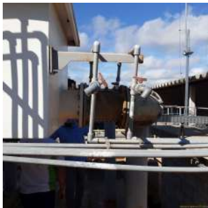
Foto 13 - Ponto de aplicação de cloro e flúor.
