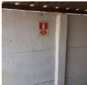
Foto 1 - Placa de indentificação no extintor, mas sem o equipamento no local.
