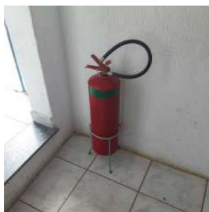
Foto 6 - Extintor de incêndio instalado na edificação da sede próxima à elevatória.
