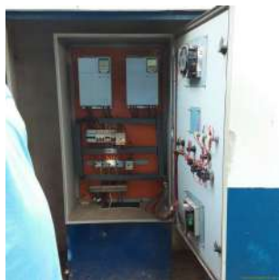
Foto 13 - Detalhe do painel elétrico dos equipamentos do poço.
