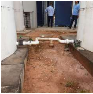
Foto 11 - Tubo de comunicação entre os dois reservatórios.
