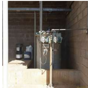
Foto 21 - Tanques de produtos químicos e bombas dosadoras.
