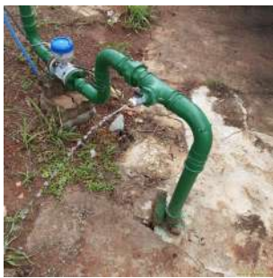
Foto 8 - Torneira para coleta de água bruta.
