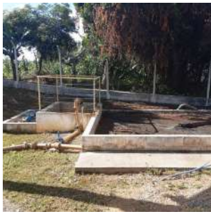
Foto 17 - Tubulação que conduz o lodo proveniente do tanque de decantação para o geobag.
