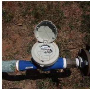
Foto 5 - Macromedidor de vazão.
