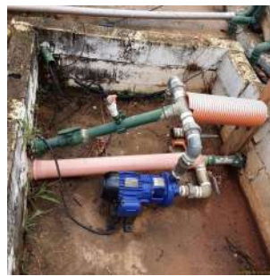
Foto 6 - Vista geral da estação elevatória.
