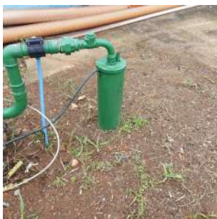
Foto 1 - Detalhe da tubulação na boca do poço, sem laje de proteção no entorno.
