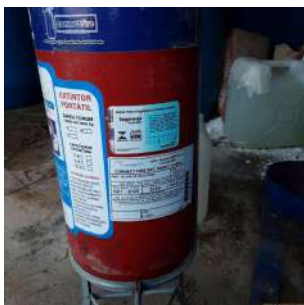
Foto 13 - Detalhe da etiqueta de controle de manutenções do extintor - dentro da validade.
