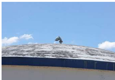
Foto 2 - Tubo de ventilação do reservatório maior - sem tela de proteção.
