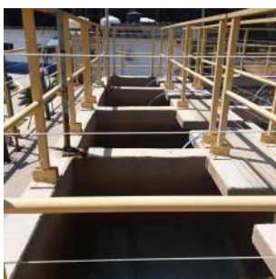
Foto 12 - Filtros do módulo 1.
