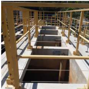
Foto 18 - Filtros do módulo 3.
