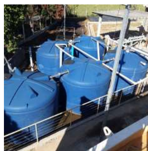
Foto 6 - Vista geral dos reservatórios. Os três reservatórios mais próximos da ETA são utilizados nas operações de lavagem de filtros.
