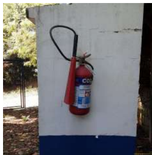
Foto 14 - Extintor de incêndio instalado na parede externa do abrigo dos painéis elétricos.
