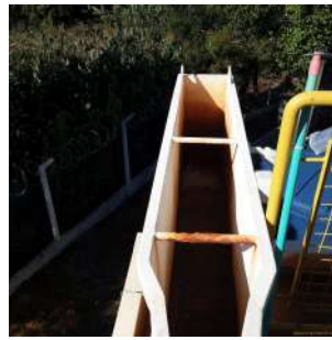
Foto 8 - Canaleta de distribuição.
