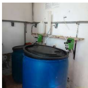
Foto 11 - Tanques de armazenamento e bombas dosadoras de cloro e flúor.
