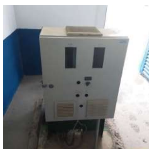
Foto 7 - Painel elétrico da elevatória.
