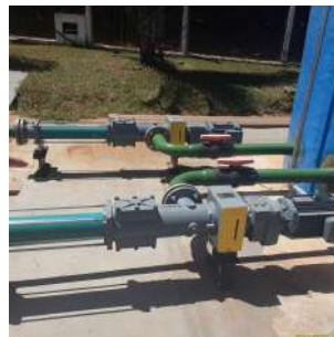
Foto 13 - Bombas do sistemas.
