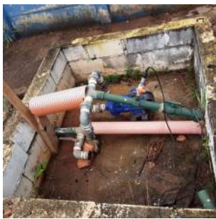
Foto 5 - Vista geral da estação elevatória.
