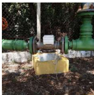
Foto 6 - Macromedidor de vazão.
