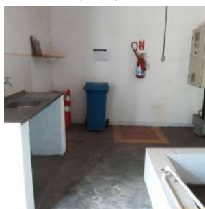
Foto 11 - Vista geral do interior da edificação. No centro da imagem é possível visualizar um extintor de incêndio próximo aos painéis elétricos.
