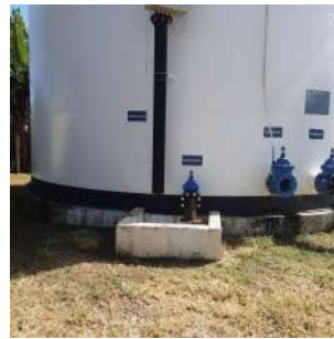
Foto 8 - Porção final do tubo extravasor e, à sua direita, o registro de descarga do reservatório. Ambas as estruturas estão identificadas com pequenas placas.
