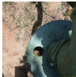
Foto 2 - Detalhe do orifício do tubo de medição de nível, é possível visualizar que o interior está preenchido por pedriscos.
