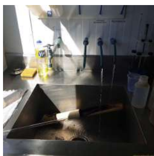
Foto 32 - Torneiras para coleta das amostras de água bruta e tratada.
