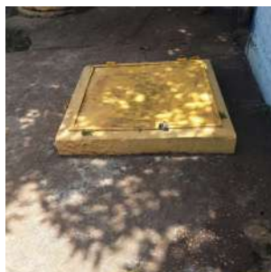
Foto 2 - Vista geral da tampa da elevatória, localizada na calçada.
