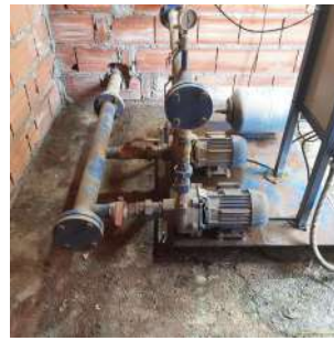
Foto 6 - Vista geral da estação elevatória.
