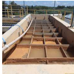
Foto 19 - Floculador do módulo 4.
