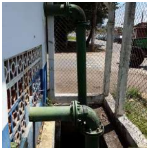
Foto 1 - Tubulações de chegada e saída da água.
