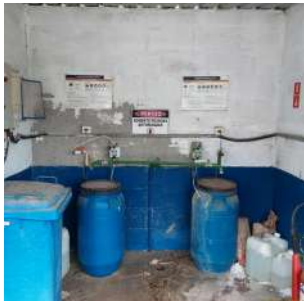
Foto 10 - Tanques de armazenamento e bombas dosadoras de cloro e flúor.
