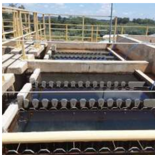
Foto 20 - Decantadores do módulo 4.
