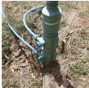
Foto 6 - Ponto de aplicação de cloro e flúor na água bruta.
