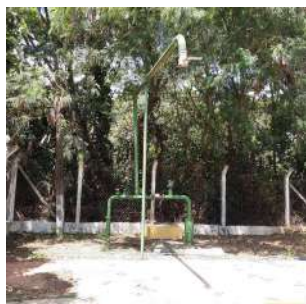
Foto 3 - Vista geral da estrutura do poço. Há um ponto de carregamento de caminhão pipa junto ao poço.
