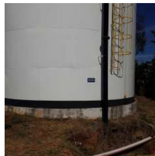
Foto 10 - Identificação da tubulação de entrada da água no reservatório.
