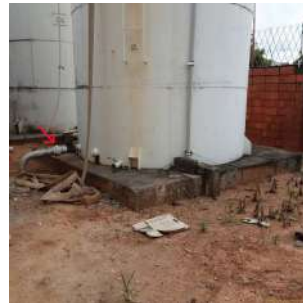
Foto 15 - Base do Reservatório 2. A seta vermelha indica a tubulação de saída da água do reservatório. Há uma mangueira de medição de nível conectada a essa tubulação.
