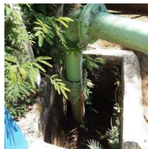
Foto 7 - Tubulação de saída da água bombeada.
