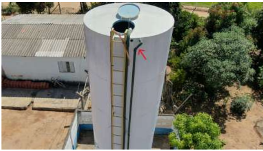
Foto 7 - Detalhe das tubulações no topo do reservatório. A seta vermelha indica o tubo extravasor, à sua esquerda está o orifício de ventilação do reservatório.
