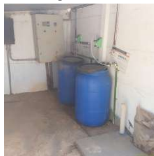
Foto 8 - Tanques de armazenamento e bombas dosadoras de cloro e flúor.
