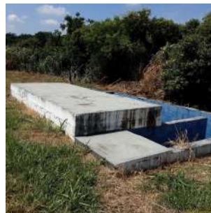
Foto 18 - Estrutura que abriga a tubulação que sai da elevatória e o macromedidor de vazão de entrada do efluente bruto no sistema de tratamento.
