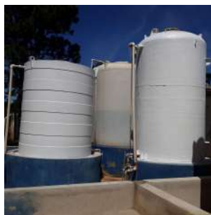
Foto 4 - Vista geral dos tanques de armazenamento.
