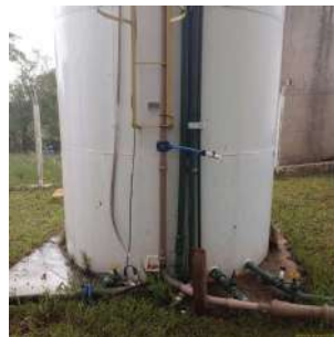
Foto 6 - Tubulações de entrada e saída da água do reservatório.
