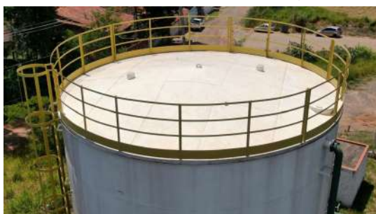
Foto 8 - Tubos de ventilação no topo do reservatório.
