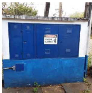
Foto 3 - Abrigo dos painéis elétricos.
