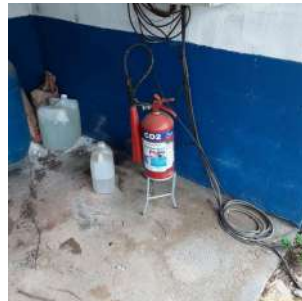
Foto 8 - Extintor de incêndio instalado próximo aos painéis elétricos.
