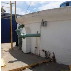
Foto 1 - Tubo extravasor com o cotovelo voltado para cima.
