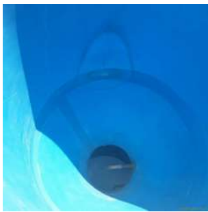
Foto 10 - Vista interna do tanque Dortmund.
