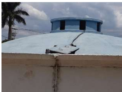
Foto 1 - Detalhe da tampa do reservatório parcialmente aberta.
