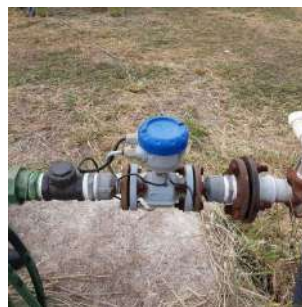
Foto 6 - Macromedidor de vazão.
