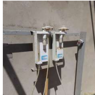
Foto 13 - Detalhe do clorador - dosagem de pré e pós cloração.
