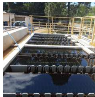
Foto 17 - Decantadores do módulo 3.
