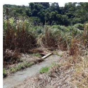
Foto 2 - Ponto com vazamento de efluente tratado. Logo abaixo deste ponto está o lançamento final do efluente no corpo d'água.
