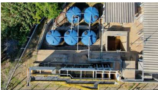
Foto 5 - Vista aérea da ETA compacta, composta por floculador, decantador e três filtros.
