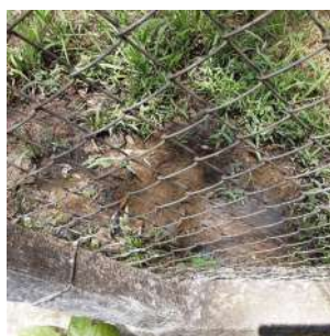
Foto 2 - Detalhe do ponto de descarte da água para fora da área da elevatória.
