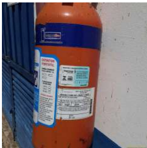
Foto 24 - Detalhe da etiqueta de controle de manutenções do extintor - dentro da validade.
