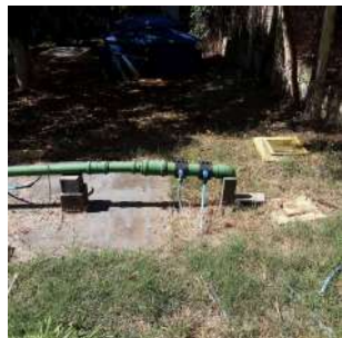
Foto 9 - Ponto de aplicação de cloro e flúor na água bruta.
