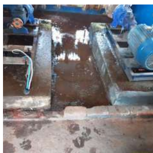
Foto 1 - Barreira e desnível para contenção da água de lubrificação das gaxetas.
