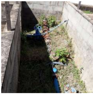
Foto 10 - Caixa com a tubulação, registro de manobra e macromedidor da vazão de saída da água do reservatório.
