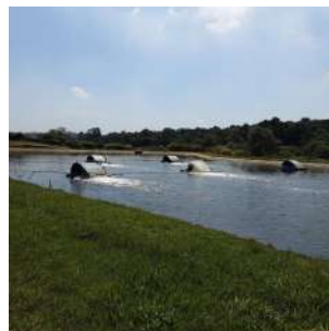
Foto 7 - Detalhe dos aeradores.
