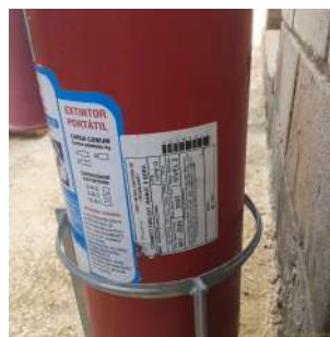
Foto 27 - Detalhe da etiqueta de controle de manutenções do extintor - dentro da validade.
