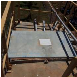
Foto 22 - Tanque de contato que recebe a água tratada dos módulos 1 e 2. Neste tanque ocorre a dosagem de cloro e flúor na água tratada.
