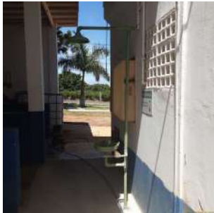
Foto 36 - Chuveiro de emergência instalado na área externa, próximo aos tanques de produtos químicos.
