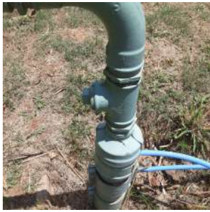
Foto 1 - Ponto para instalação da torneira e, abaixo, ponto de aplicação de cloro e flúor na água.
