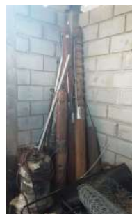
Foto 16 - Bombas reserva de poço armazenadas no almoxarifado.
