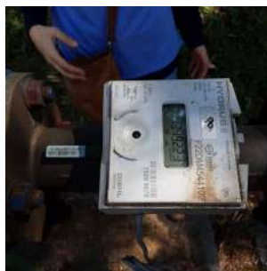
Foto 6 - Macromedidor de vazão.
