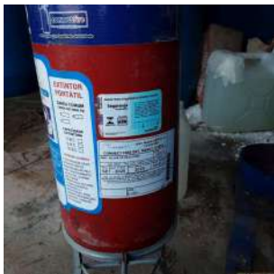
Foto 9 - Detalhe da etiqueta de controle de manutenções do extintor - dentro da validade.
