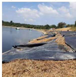
Foto 11 - O desagendamento do lodo é feito em geobags instalados sobre uma manta de geotêxtil, o líquido percolado escoar para a alagoinha de aeração.
