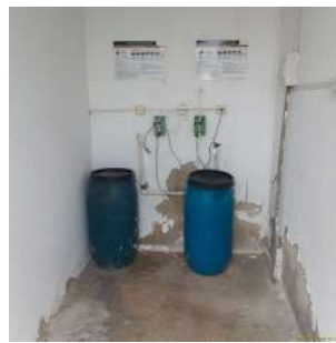
Foto 10 - Tanques de armazenamento e bombas dosadoras de cloro e flúor. É possível observar que a bomba dosadora de flúor se encontra desligada.
