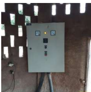
Foto 14 - Pannel elétrico no interior do antigo reservatório.
