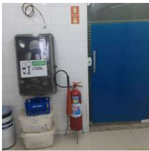
Foto 34 - Extintor de incêndio instalado no laboratório.
