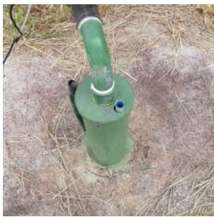
Foto 9 - Detalhe do tubo de medição de nível.
