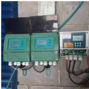
Foto 22 - Macromedidores de entrada e saída.
