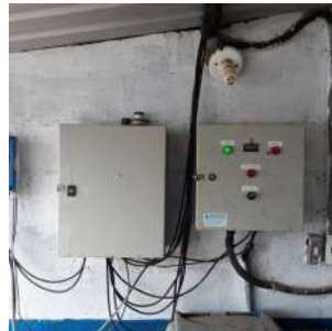
Foto 11 - Painéis elétricos do poço.
