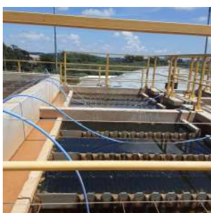
Foto 14 - Decantadores do módulo 2.
