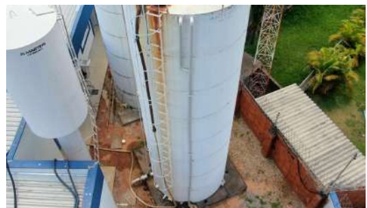
Foto 10 - Tubulação de entrada de água no reservatório 2.
