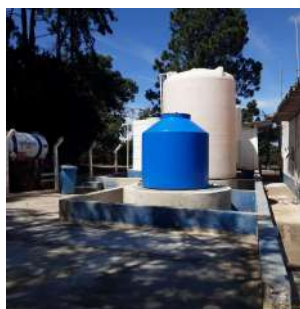
Foto 2 - Vista geral do pátio de estocagem de produtos químicos.
