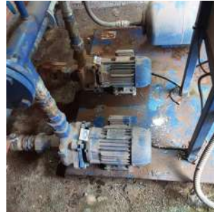
Foto 7 - Há dois conjuntos moto-bomba instalados, um em funcionamento e o segundo como reserva.
