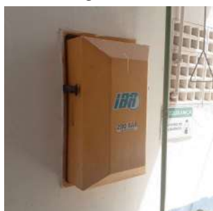
Foto 3 - Máscara autônoma instalada na parede externa da edificação - caixa fechada.
