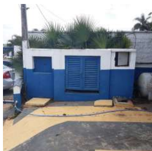
Foto 5 - Abrigo do painel elétrico, instalado na calçada.
