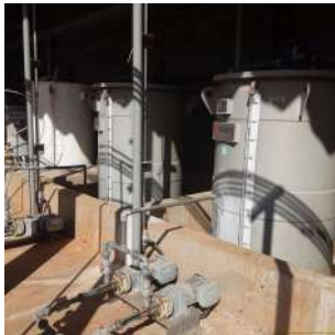
Foto 20 - Tanques de produtos químicos e bombas dosadoras.
