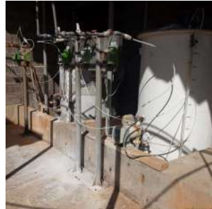
Foto 19 - Tanques de produtos químicos e bombas dosadoras.
