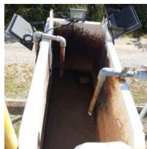
Foto 6 - Ponto de entrada da água bruta e aplicação de produtos químicos do tratamento.
