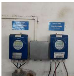
Foto 33 - Medidores de vazão de saída da água tratada.
