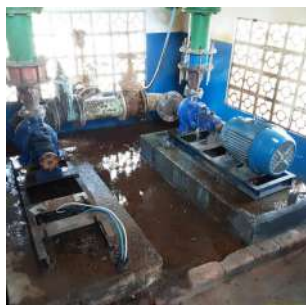
Foto 5 - Vista geral dos equipamentos no interior da edificação.
