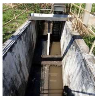
Foto 14 - Gradeamento na canaleta de entrada do efluente bruto na elevatória.
