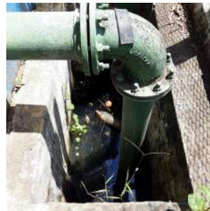
Foto 2 - Detalhe do acúmulo de água e resíduos no interior da caixa.
