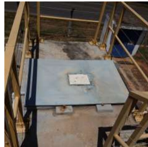
Foto 23 - Tanque que recebe a água tratada dos módulos 3 e 4. Neste ponto não há dosagem de cloro e flúor, segundo o prestador, a água que passa por esse tanque é misturada à água com cloro e flúor que sai do tanque de contato dos módulos 1 e 2.
