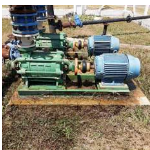
Foto 1 - Detalhe da drenagem inadequada da água de lubrificação das gaxetas.
