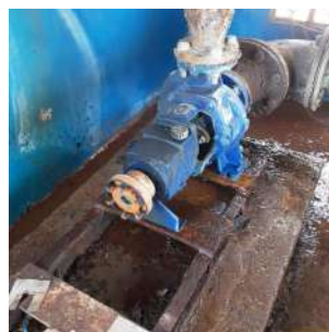
Foto 8 - Conjunto moto-bomba reserva. No momento da fiscalização havia apenas a bomba no local, segundo o prestador, o motor havia sido retirado para manutenção.
