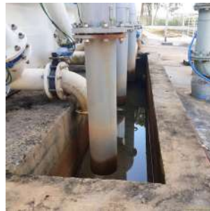
Foto 14 - Tubulação de saída da água de lavagem dos filtros.
