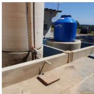
Foto 3 - Vista geral dos tanques de armazenamento.
