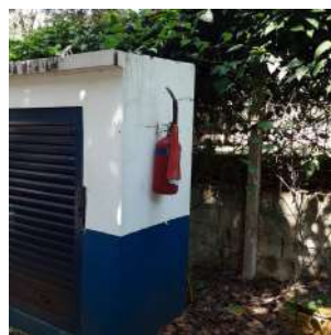
Foto 8 - Extintor de incêndio instalado na edificação que abriga os painéis elétricos.
