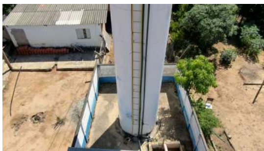
Foto 1 - Detalhe da escada de acesso ao topo do reservatório sem guarda-corpos.
