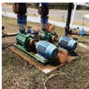
Foto 4 - Há dois conjuntos moto-bomba instalados, um em funcionamento e o segundo como reserva.
