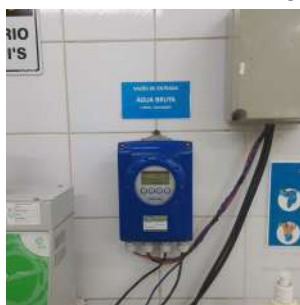
Foto 32 - Medidor de vazão de entrada da água bruta.
