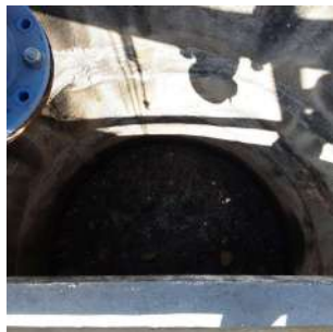
Foto 17 - Vista do interior do poço de bombeamento que não está em uso. Segundo o prestador, o funcionamento de apenas um poço é suficiente para recalcar o efluente recebido, a bomba deste poço está armazenada no almoxarifado da sede.
