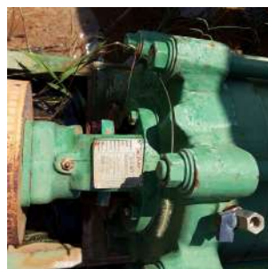
Foto 6 - Etiqueta de identificação da bomba 2.
