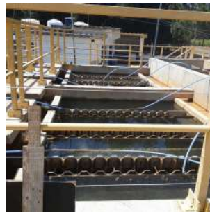
Foto 11 - Decantadores do módulo 1. Segundo o prestador, as mangueiras azuis são utilizadas para aplicação de cloro na água clarificada que sai do decantador quando há a necessidade de remoção de amônia.
