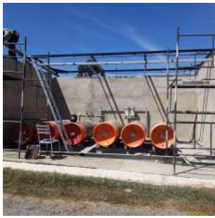
Foto 10 - Vista geral do interior da edificação e cilindros de gás cloro.
