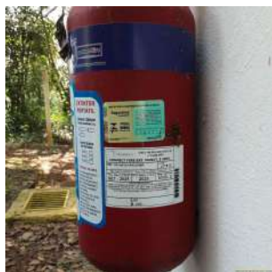
Foto 15 - Detalhe da etiqueta de controle de manutenções do extintor - dentro da validade.
