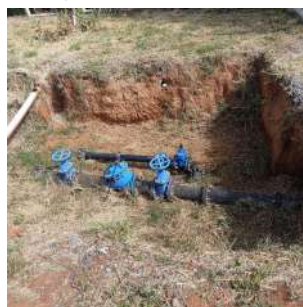
Foto 11 - Caixa com registros e tubulação de entrada.
