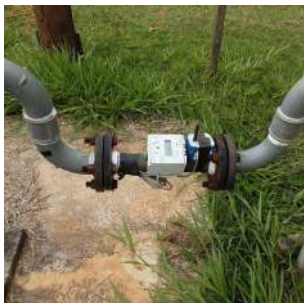
Foto 5 - Macromedidor de vazão.
