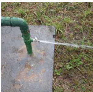
Foto 7 - Torneira para coleta de água bruta.
