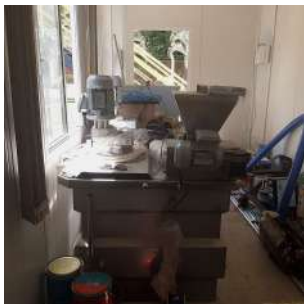
Foto 14 - Equipamento para dosagem de polímero.
