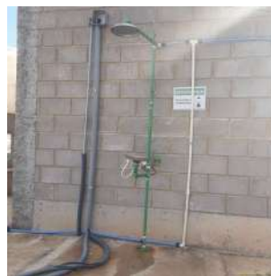
Foto 29 - Chuveiro de emergência instalado próximo à área de estocagem de produtos químicos.
