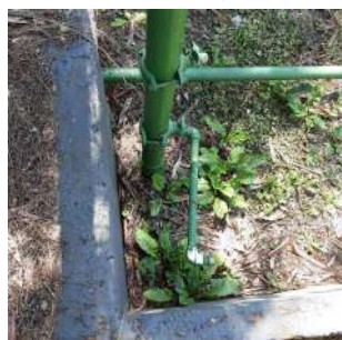
Foto 7 - Torneira para coleta de água bruta.
