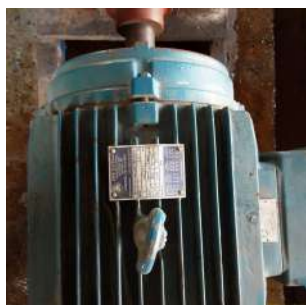
Foto 7 - Etiqueta de identificação do motor da bomba em funcionamento.
