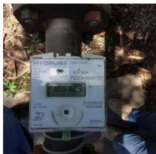
Foto 7 - Detalhe da tela do macromedidor de vazão.
