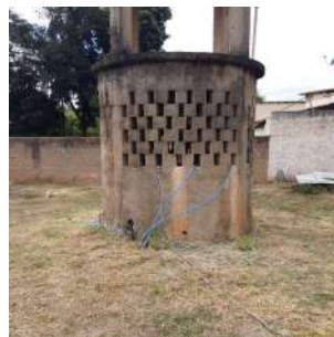
Foto 13 - Mangueiras de dosagem de cloro e flúor.
