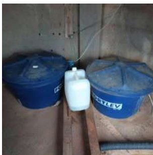
Foto 11 - Tanques de armazenamento de cloro e flúor.
