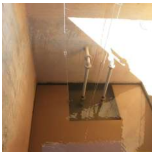
Foto 15 - Tanque de decantação de lodo.
