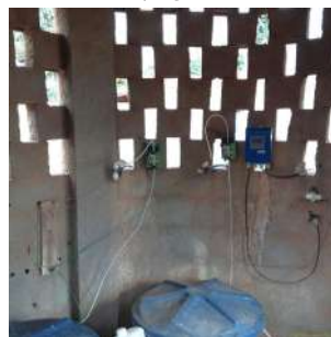
Foto 12 - Bombas dosadoras de cloro e flúor.
