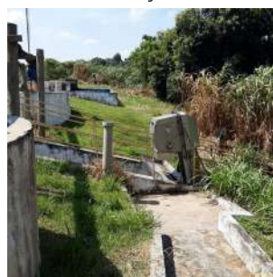
Foto 13 - Ponto de entrada do efluente bruto na elevatória.
