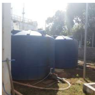
Foto 7 - Dois reservatórios utilizados para armazenamento e distribuição da água tratada.
