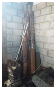
Foto 16 - Bombas reserva de poço armazenadas no almoxarifado.
