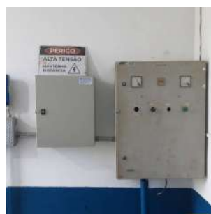
Foto 8 - Painéis elétricos da elevatória.
