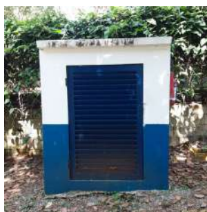
Foto 12 - Abrigo dos painéis elétricos.
