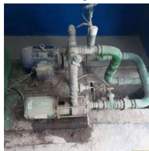
Foto 6 - Vista geral da estação elevatória. Segundo o prestador, o equipamento verde é o conjunto motobomba reserva desta elevatória.
