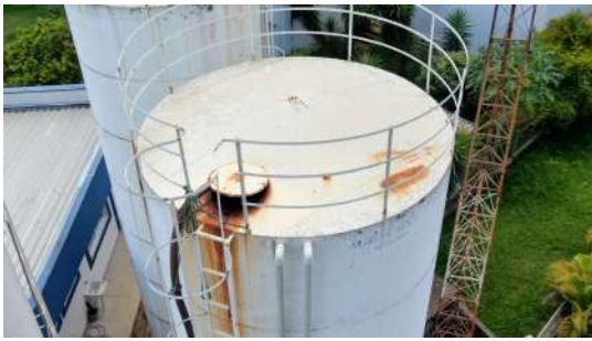
Foto 1 - Detalhe da tampa do reservatório parcialmente aberta e com sinais de oxidação na base.
