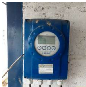
Foto 7 - Tela do medidor de vazão.
