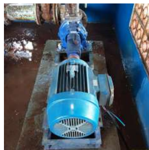
Foto 6 - Conjunto moto-bomba em funcionamento no momento da fiscalização.
