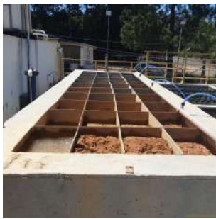
Foto 16 - Floculador do módulo 3.
