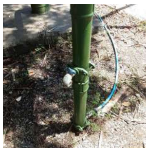
Foto 9 - Torneira para coleta de água bruta e, logo abaixo, ponto de aplicação de cloro na água.
