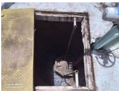
Foto 1 - Poço contendo cesto do gradeamento grosseiro.
