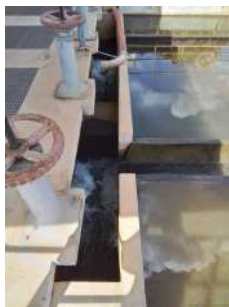
Foto 14 - Entrada de água nos filtros.
