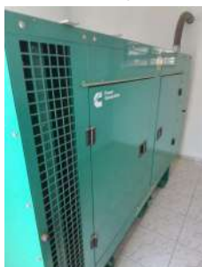
Foto 8 - Gerador da EEE (inoperante).
