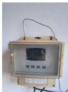
Foto 7 - Medidor de vazão de entrada.
