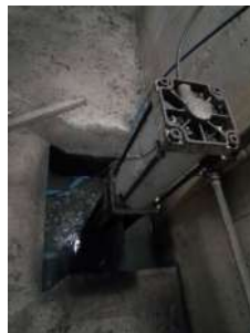
Foto 5 - Tanque de entrada de esgoto.
