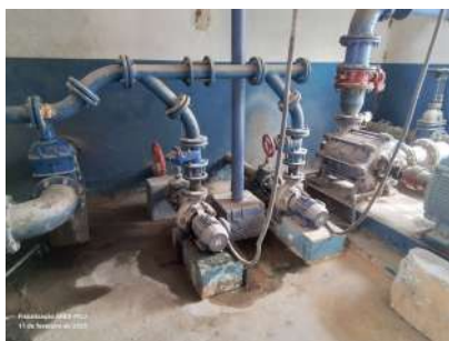
Foto 1 - Vista do interior da edificação que abriga a EEAT. No centro da foto, conjunto motobomba que recalca para o Florido.
