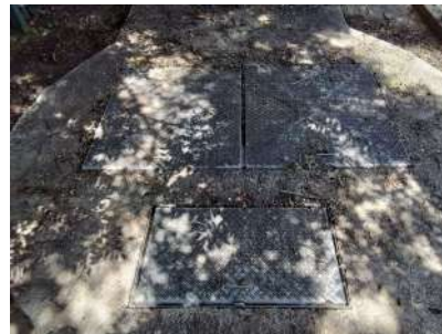
Foto 2 - Tampas de acesso ao conjunto motobomba e ao gradeamento grosseiro.
