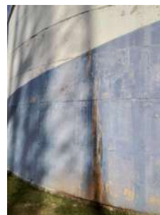
Foto 2 - Vazamento na estrutura do reservatório.
