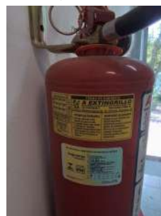
Foto 4 - Extintor dos painéis de comando, com última manutenção realizada em jan/24 e próxima manutenção de 2° deveria ter sido realizada em jan/25.
