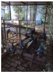
Foto 5 - Bombas que direcionam o lodo à centrífuga.
