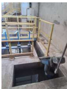
Foto 6 - Detalhe do tanque de desarenação.
