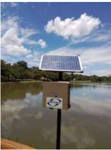
Foto 2 - Placa solar e equipamento de telemetria para medição da vazão.
