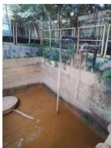
Foto 4 - Tanque de decantação de lodo.
