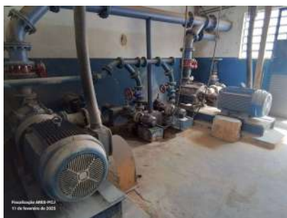
Foto 1 - Vista geral do interior da EEAT (conjunto motobomba nas extremidades recalca para o reservatório Florido).
