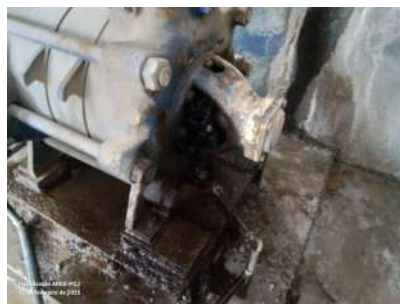
Foto 4 - Vazamento na segunda drenagem na bomba da esquerda.
