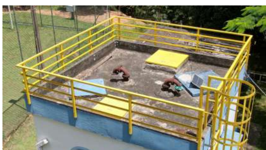
Foto 1 - Tubulação de ventilação no topo do reservatório.
