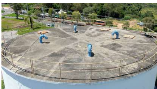
Foto 1 - Tubulação de ventilação no topo do reservatório.
