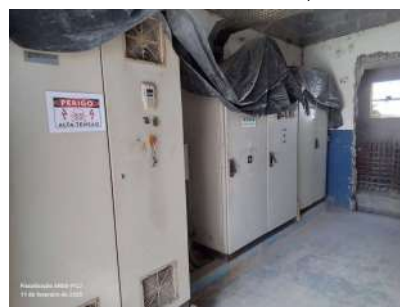
Foto 4 - Painéis de energia e de controle da EEAT.
