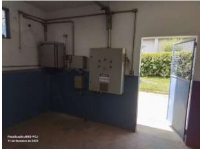
Foto 4 - Painéis de energia e de controle da EEA.
