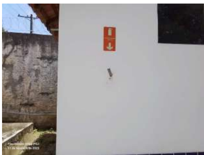
Foto 1 - Ausência de extintor de incêndio.
