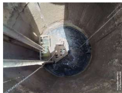
Foto 2 - Gradeamento grosseiro com material obstruindo o cesto.
