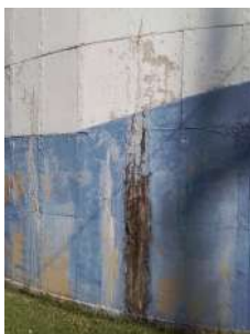
Foto 1 - Vazamento na estrutura do reservatório.
