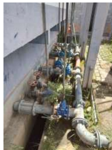
Foto 17 - Tubulações pós-filtração que direcionam água para o reservatório de concreto da ETA.
