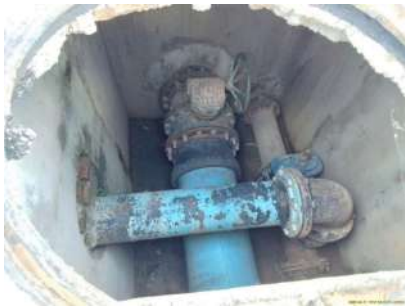
Foto 2 - Tubulações do reservatório.
