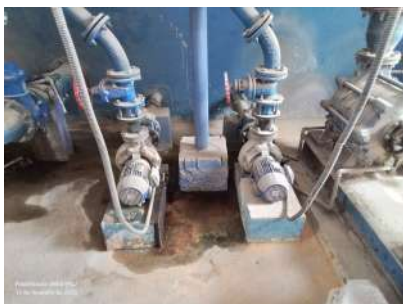
Foto 1 - Conjunto motobomba que recalca para o reservatório Castelo.
