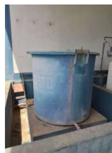
Foto 3 - Tanque de armazenamento de flúor.
