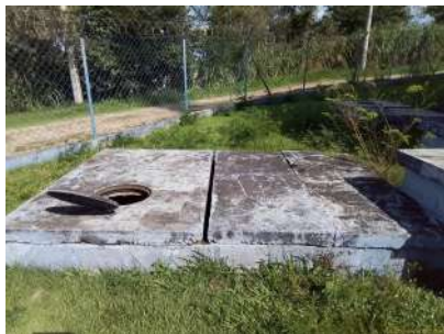
Foto 3 - Tampa aberta do tanque de tubulação.
