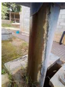
Foto 1 - Vazamento na tubulação de lavagem do filtro.
