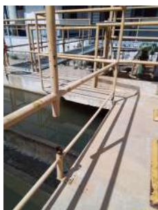
Foto 1 - Guarda-corpo da unidade de decantação danificado.
