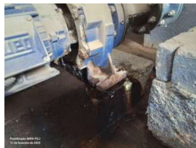
Foto 2 - Detalhe do vazamento na bomba da esquerda.
