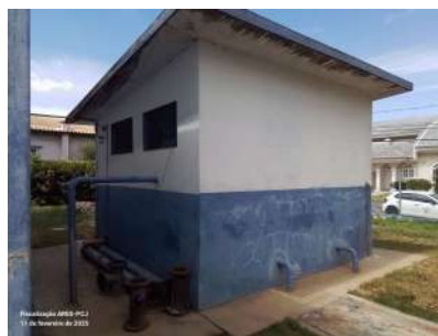
Foto 6 - Tubulação de recalque da EEA.
