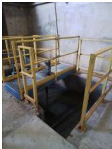
Foto 2 - Tanque de desarenação com excesso de material.
