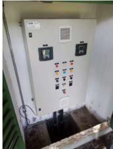
Foto 3 - Painel de comando da EEE.
