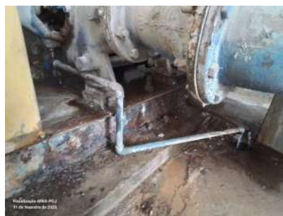
Foto 2 - Vazamento na tubulação de drenagem da bomba esquerda.
