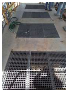
Foto 15 - Vista geral da unidade de filtração.
