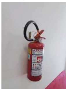
Foto 3 - Extintor dos painéis de comando, com última manutenção realizada em jan/24 e próxima manutenção de 2° deveria ter sido realizada em jan/25.
