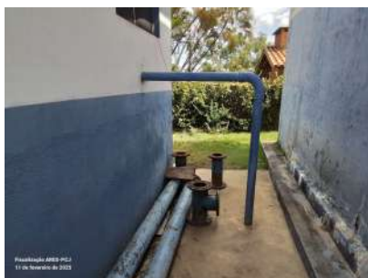
Foto 5 - Vista da tubulação de recalque da EEA.
