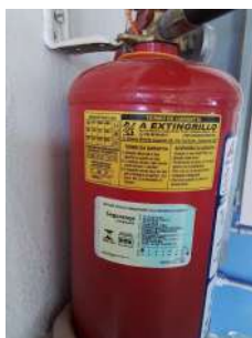
Foto 3 - Detalhe do extintor do prédio do laboratório com manutenção vencida.
