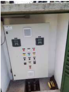
Foto 2 - Painel de controle da EEE.
