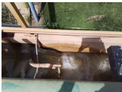
Foto 8 - Entrada de água bruta e aplicação de PAC.
