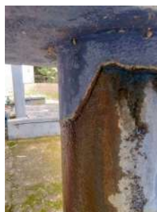
Foto 2 - Detalhe do vazamento.
