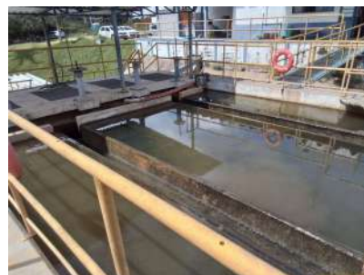
Foto 13 - Tanque de decantação e unidades de filtração (ao fundo).
