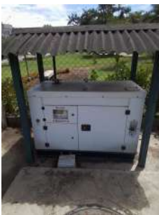
Foto 2 - Gerador da EEE.
