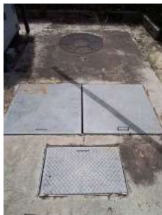
Foto 1 - Tampas de acesso ao gradeamento grosseiro e ao conjunto motobomba.
