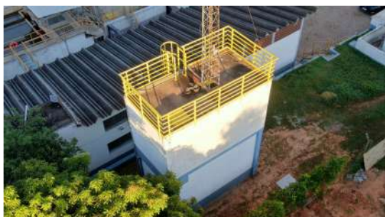
Foto 1 - Tubulação de ventilação no topo de reservatório.
