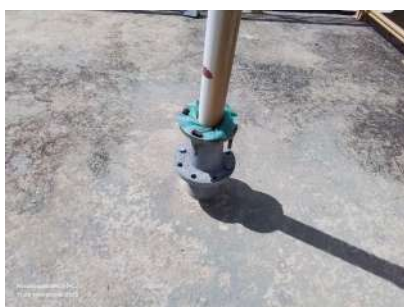
Foto 1 - Rede de proteção no medidor de nível.
