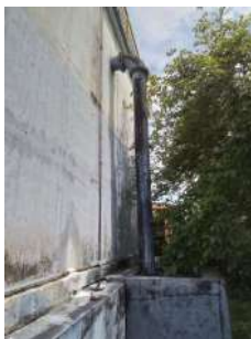
Foto 1 - Tubo extravasor do reservatório.
