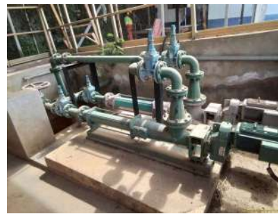
Foto 6 - Bombas que retornam a água decantada ao processo de tratamento.
