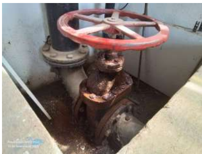
Foto 1 - Vazamento na válvula da tubulação na base do reservatório.
