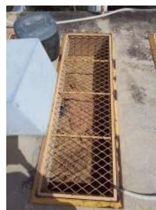
Foto 10 - Unidade de floculação.
