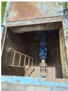
Foto 2 - Válvula redutora de pressão na tubulação do reservatório.
