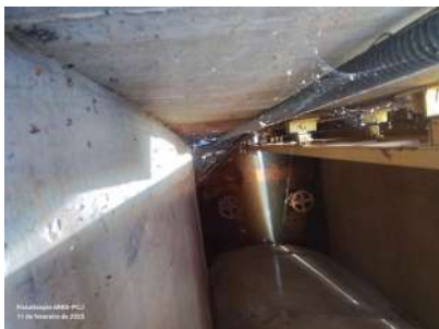
Foto 1 - Caixa de válvulas com acúmulo de água.
