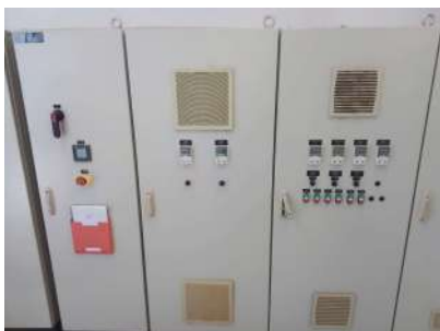
Foto 10 - Painéis de comando das bombas.
