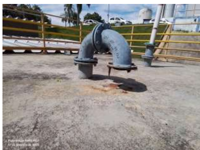
Foto 1 - Tubulação de ventilação do reservatório.
