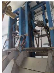
Foto 2 - Detalhe da grade mecanizada.
