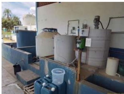
Foto 1 - Tanques de armazenamento de produtos químicos.
