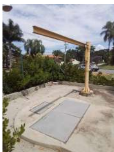
Foto 1 - Suporte para talha e tampa de acesso para o conjunto motobomba.
