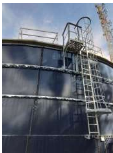
Foto 1 - Guarda-corpo na escada e no topo do reservatório.
