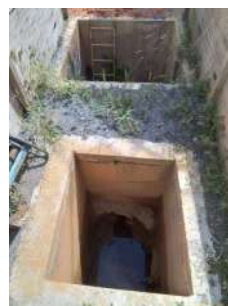
Foto 2 - Poço de chegada do lodo.
