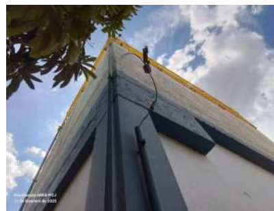
Foto 2 - Cabo de aterramento do para-raio.
