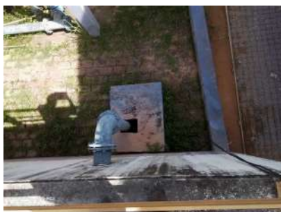
Foto 1 - Tubo extravasor do reservatório.
