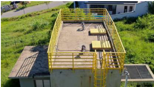
Foto 1 - Tubulação de ventilação no topo do reservatório.
