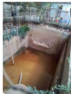
Foto 3 - Tanque de decantação de lodo.
