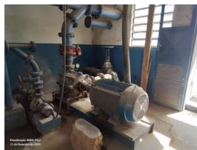
Foto 2 - Conjunto motobomba (bomba direita, reserva).
