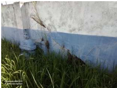
Foto 2 - Vazamento próximo à base do reservatório.
