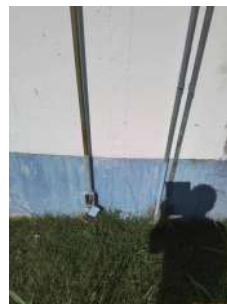
Foto 2 - Aterramento do para-raio.
