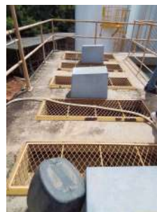
Foto 9 - Vista geral da unidade de floculação.
