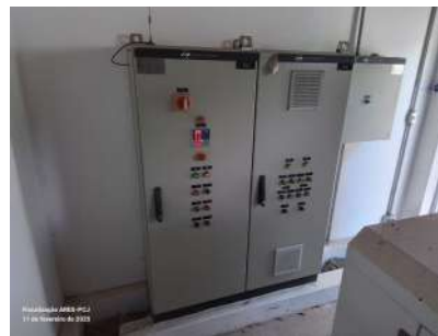
Foto 6 - Painel elétrico e de comando da EEEB.
