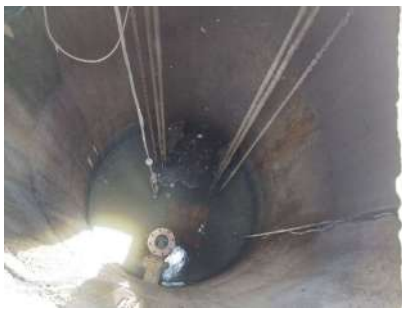
Foto 1 - Poço contendo o conjunto motobomba submerso.
