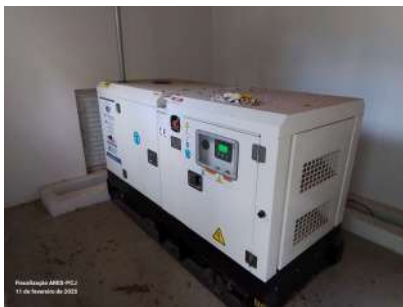
Foto 5 - Gerador de energia da EEEB.
