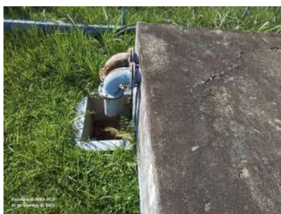
Foto 1 - Tubo extravasor do reservatório.
