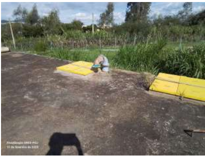
Foto 2 - Tubulação de ventilação do reservatório.
