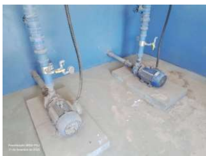
Foto 1 - Conjunto motobomba da EEA.
