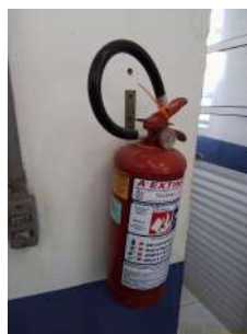
Foto 4 - Extintor próximo à porta do laboratório com validade vencida.
