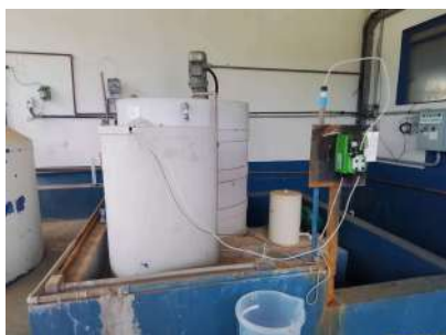
Foto 4 - Tanque de armazenamento de flúor (à frente) e de ortopolifosfato de sódio (ao fundo).
