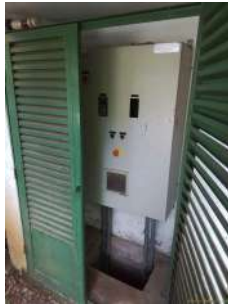
Foto 3 - Painel elétrico e de comando da EEE.
