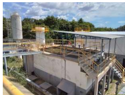
Foto 2 - Módulo de tratamento da água (floculadores, decantadores e filtros).
