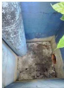
Foto 2 - Tanque de saída do tubo extravasor.
