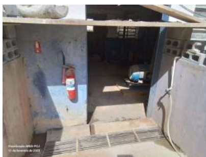
Foto 1 - Extintor de incêndio na entrada da edificação que abriga a EEAT.
