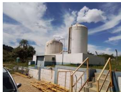
Foto 6 - Tanque de armazenamento de PAC.
