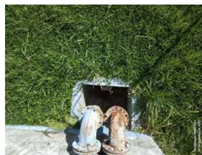
Foto 2 - Tubo extravasor do reservatório.
