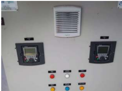
Foto 4 - Detalhe do painel de comando da EEE.
