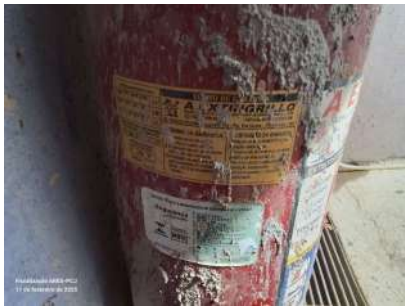
Foto 1 - Extintor vencido. Última revisão de 2º nível realizada em jan/2024 e a próxima revisão deveria ter sido realizada em jan/25.
