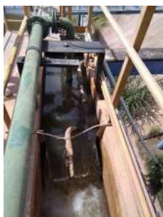
Foto 1 - Sensor de medição de vazão na entrada da ETA.
