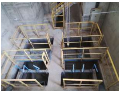
Foto 3 - Tanques de desarenação (primeiro plano) e calha Parshall (ao fundo).
