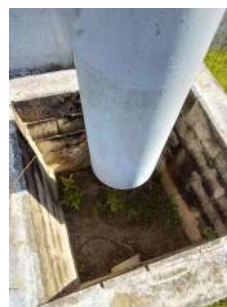
Foto 2 - Tanque de saída do tubo extravasor.
