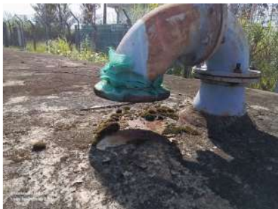
Foto 1 - Tela de proteção na tubulação de ventilação.
