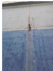
Foto 2 - Vazamento em rachadura do reservatório.
