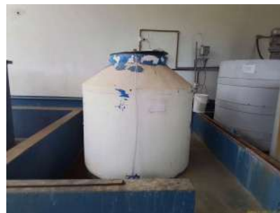
Foto 2 - Tanque de armazenamento de hipoclorito.
