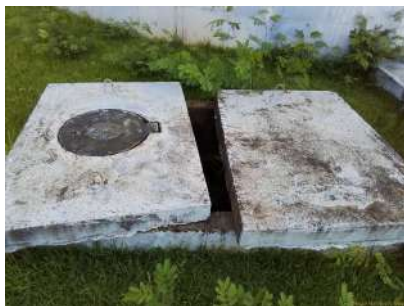
Foto 1 - Laje de concreto mal posicionada.
