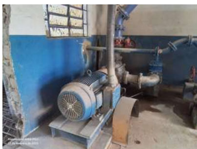
Foto 1 - Conjunto motobomba (bomba esquerda)
