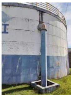
Foto 1 - Tubo extravasor do reservatório.
