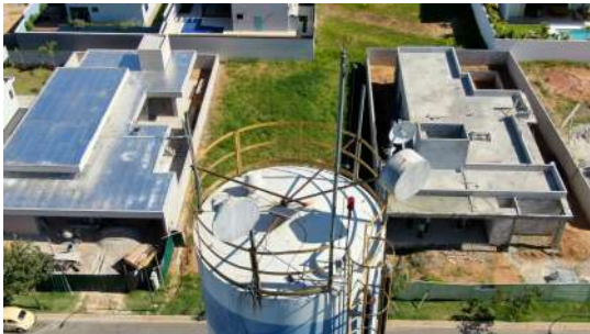
Foto 1 - Para-raio no topo do reservatório.
