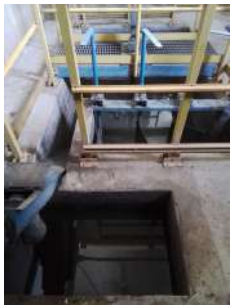
Foto 1 - Tanque de desarenação com excesso de material.
