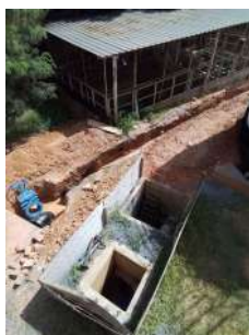
Foto 1 - Vista geral da Estação de Tratamento de Lodo. Tanque de chegada do lodo (primeiro plano) e tanque de sedimentação e bombas ao fundo (área coberta).
