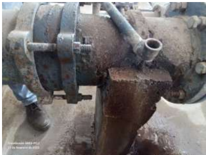
Foto 2 - Detalhe do vazamento na tubulação de sucção antes do registro na bomba da esquerda.
