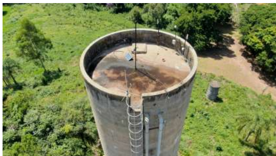
Foto 1 - Para-raio no topo do reservatório.
