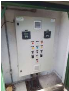
Foto 3 - Painel de comando da EEE.
