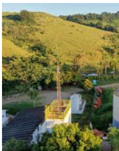
Foto 3 - Para-raio no topo do reservatório.
