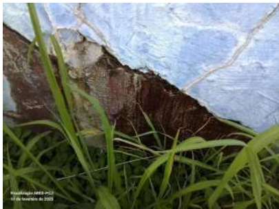
Foto 1 - Detalhe do vazamento próximo à base do reservatório.
