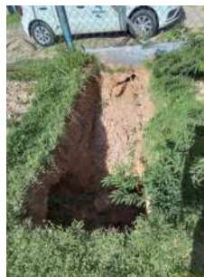
Foto 2 - Vala aberta na área do reservatório.
