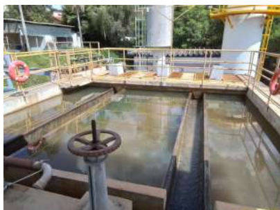
Foto 11 - Vista geral do tanque de decantação e floculadores (ao fundo).
