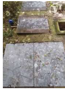
Foto 2 - Laje da EEE com as tampas de acesso aos poços.
