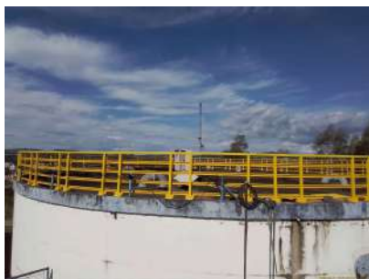
Foto 1 - Para-raio no reservatório ao lado.
