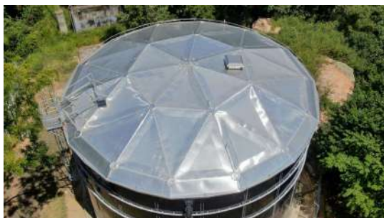
Foto 1 - Guarda-corpo na escada e proteção ao redor da tampa de inspeção no topo do reservatório.
