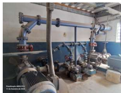
Foto 2 - Vista geral do interior da EEAT (conjunto motobomba nas extremidades recalca para o reservatório Florido).
