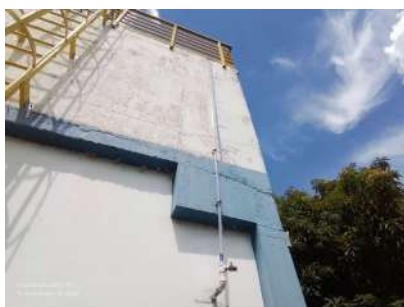
Foto 1 - Tubulação para medição de nível.
