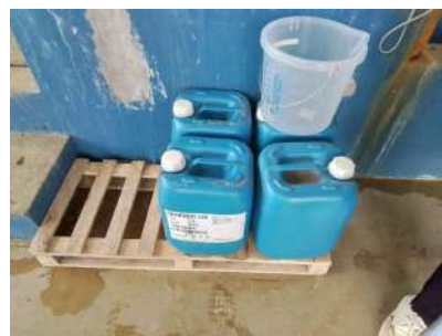
Foto 5 - Galões de armazenamento de polifosfato.
