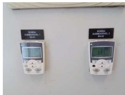
Foto 11 - Detalhe do painel de comando das bombas.
