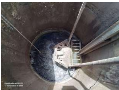
Foto 1 - Gradeamento grosseiro com material obstruindo o cesto.
