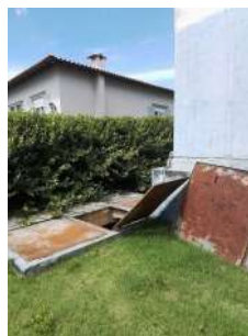
Foto 2 - Material acumulado ao redor do reservatório.
