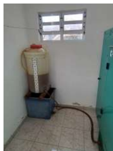
Foto 9 - Tanque de diesel do gerador.
