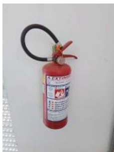
Foto 1 - Extintor da sala do gerador, com última manutenção realizada em jan/24 e próxima manutenção de 2° deveria ter sido realizada em jan/25.
