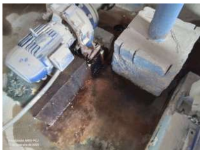
Foto 1 - Vazamento no selo mecânico da bomba da esquerda.
