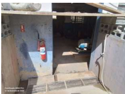
Foto 1 - Extintor na entrada da edificação a EEAT.
