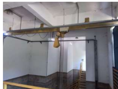
Foto 2 - Talha para içamento das bombas do tanque de desarenação.
