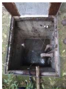
Foto 2 - Poço da EEE com a bomba em operação.
