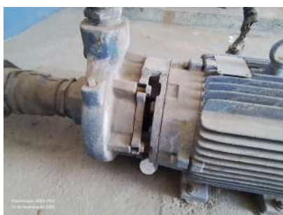
Foto 1 - Bomba com selo mecânico.
