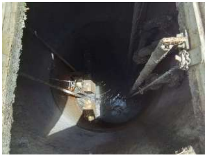
Foto 1 - Cesto do gradeamento grosseiro com acúmulo de material.
