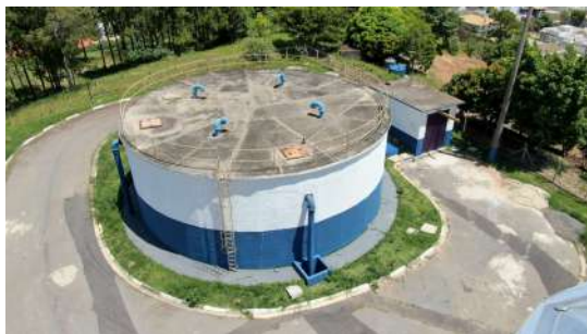
Foto 1 - Guarda-corpo na escada e no topo do reservatório.
