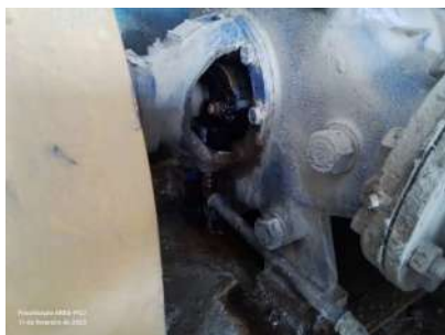
Foto 3 - Detalhe do vazamento na tubulação de drenagem da bomba esquerda.
