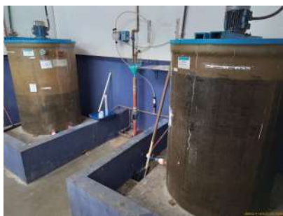
Foto 7 - Tanques de armazenamento de PAC.
