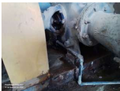
Foto 1 - Vazamento na tubulação de drenagem da bomba esquerda.
