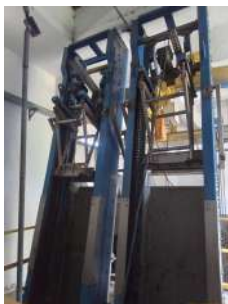
Foto 1 - Grade mecanizada do gradeamento grosseiro.
