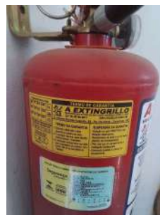
Foto 2 - Extintor da sala do gerador, com última manutenção realizada em jan/24 e próxima manutenção de 2° deveria ter sido realizada em jan/25.
