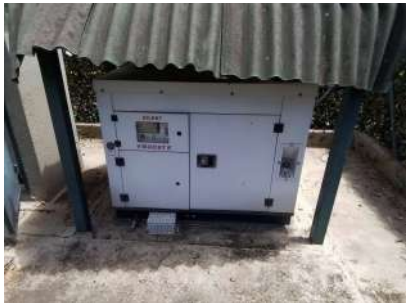
Foto 3 - Gerador da EEE.
