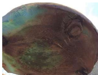
Foto 2 - Rede de proteção na tubulação de ventilação.
