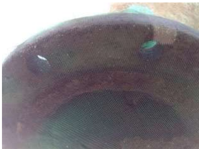
Foto 2 - Detalhe da tela de proteção na tubulação de ventilação.
