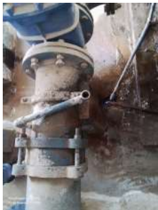
Foto 1 - Vazamento na tubulação de sucção antes do registro na bomba da esquerda.
