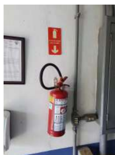
Foto 2 - Extintor do prédio do laboratório com manutenção vencida.
