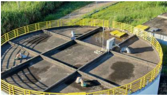
Foto 1 - Tubulações de ventilação no topo do reservatório.
