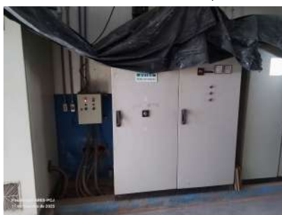
Foto 3 - Painel de controle da EEAT.
