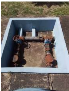
Foto 3 - Caixa de válvulas e tubulações do conjunto motobomba.
