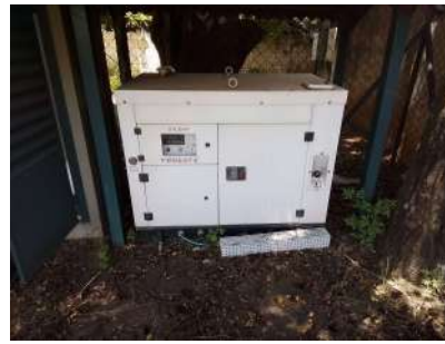
Foto 2 - Gerador da EEE.
