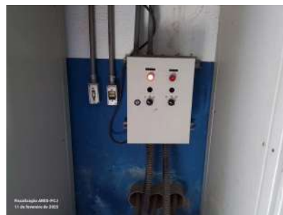
Foto 3 - Painel de controle do conjunto motobomba que recalca para o Castelo.
