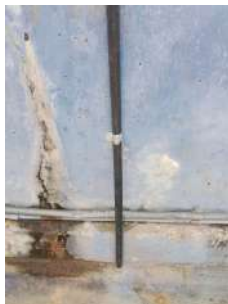
Foto 1 - Vazamento próximo à base do reservatório.
