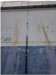
Foto 2 - Cabo de descida do para-raio.
