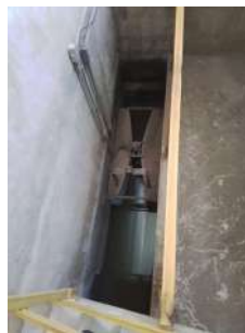
Foto 4 - Calha Parshall de entrada.
