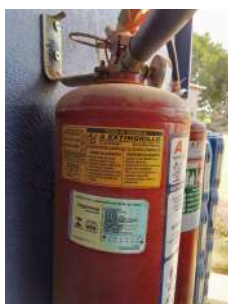
Foto 1 - Extintor do prédio da Estação de Tratamento de Lodo com manutenção vencida.
