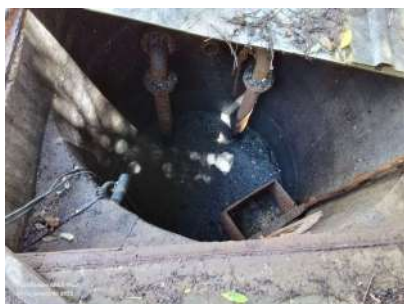
Foto 1 - Tubulações de recalque
