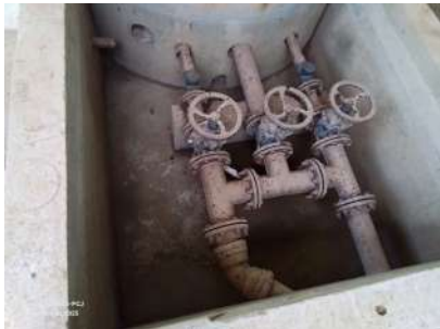
Foto 2 - Válvulas de manobra
