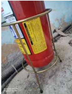
Foto 1 - Etiqueta de validade do extintor de incêndio
