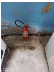
Foto 1 - Extintor de incêndio
