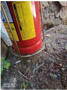
Foto 1 - Etiqueta de validade do extintor de incêndio
