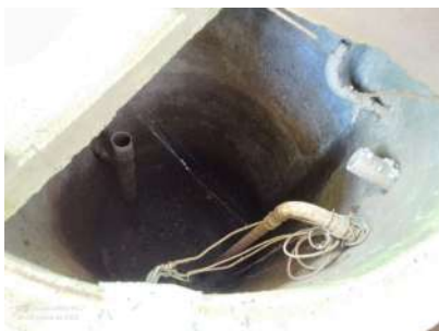
Foto 1 - Tubulação de recalque
