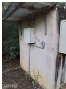
Foto 4 - Painéis elétricos das bombas
