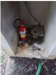
Foto 1 - Extintor de incêndio
