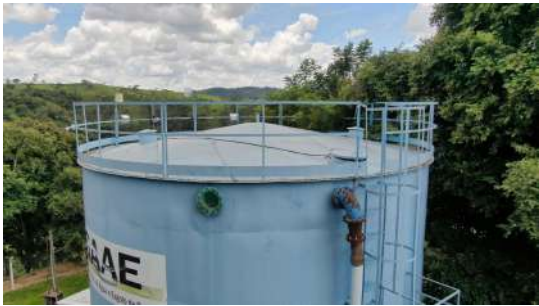
Foto 3 - Tampa de inspeção aberta ou com defeito
