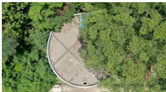
Foto 3 - Galhos das árvores encobrendo a laje do reservatório
