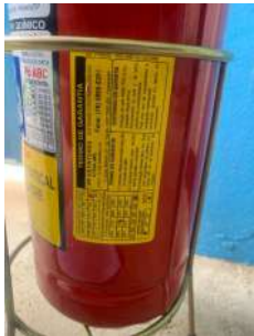
Foto 2 - Etiqueta de validade do extintor de incêndio
