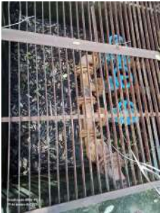
Foto 1 - Válvulas de manobra
