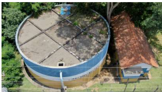
Foto 4 - Reservatório sem tampa de inspeção
