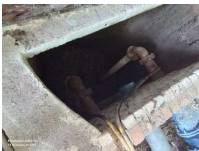
Foto 1 - Tubulações de recalque
