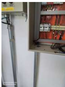
Foto 7 - Painéis elétricos das bombas
