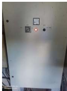
Foto 2 - Painéis elétricos das bombas
