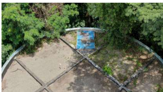
Foto 1 - Tubulação de ventilação
