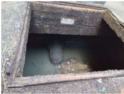
Foto 2 - Caixa com acúmulo de sedimentos 1
