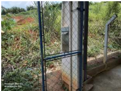
Foto 1 - Entrada da EEE
