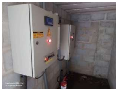
Foto 2 - Painéis elétricos das bombas
