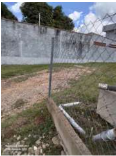
Foto 2 - Cercamento incompleto da área
