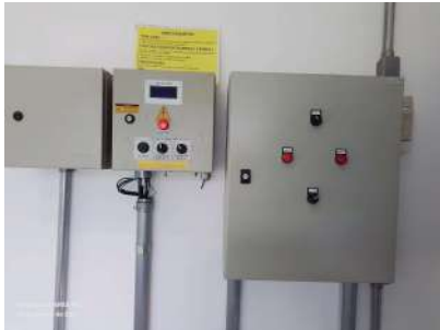
Foto 3 - Painéis elétricos das bombas
