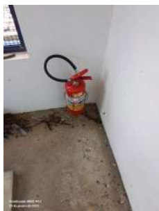
Foto 1 - Extintor de incêndio
