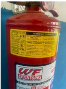
Foto 2 - Etiqueta de validade do extintor
