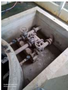
Foto 1 - Válvulas de manobra
