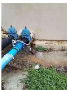
Foto 1 - Medidor de nível
