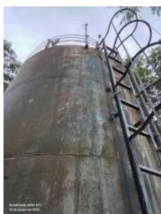
Foto 1 - Não há cabo de aterramento no reservatório
