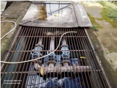
Foto 2 - Válvulas de manobra
