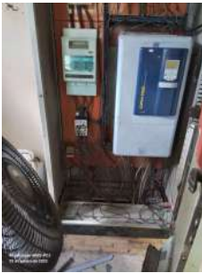
Foto 4 - Painéis elétricos das bombas
