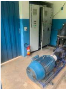
Foto 1 - Extintor de incêndio
