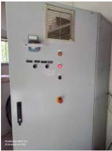
Foto 3 - Painéis elétricos das bombas
