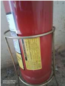
Foto 1 - Etiqueta de validade de extintor de incêndio
