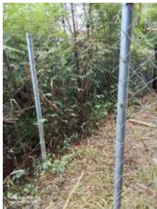
Foto 1 - Cercamento incompleto da área
