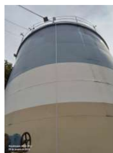
Foto 2 - Medidor de nível
