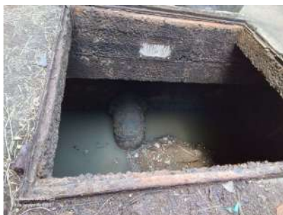
Foto 1 - Tubulação de recalque
