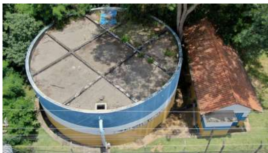
Foto 2 - Reservatório sem guarda-corpo
