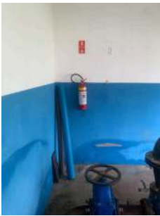
Foto 1 - Extintor de incêndio
