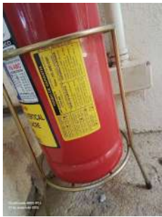
Foto 1 - Etiqueta de validade do extintor de incêndio
