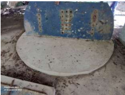
Foto 2 - Tampa em estado de deterioração 2
