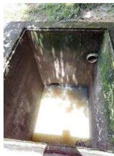
Foto 6 - Caixa de entrada de esgoto
