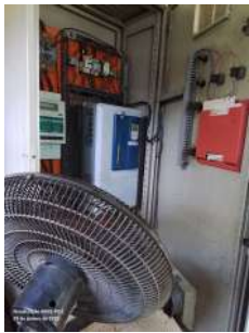
Foto 1 - Painel elétrico das bombas
