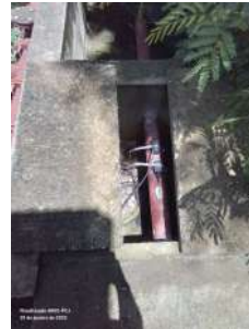
Foto 4 - Tubulação da EEE
