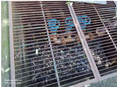
Foto 2 - Válvulas de manobra
