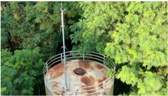
Foto 2 - Respiro na lateral da tampa de inspeção
