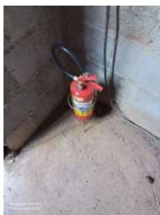
Foto 1 - Extintor de incêndio
