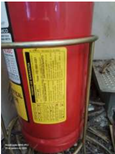
Foto 1 - Etiqueta de validade do extintor de incêndio
