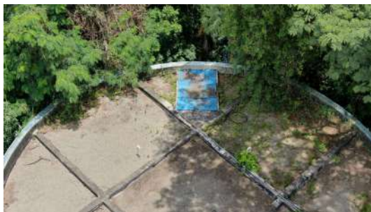
Foto 2 - Vegetação crescendo sobre a laje do reservatório
