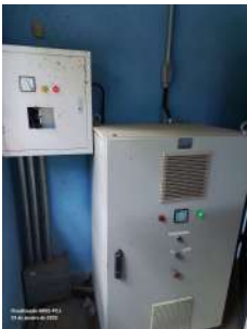
Foto 3 - Painéis elétricos das bombas
