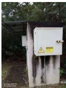
Foto 3 - Painéis elétricos das bombas
