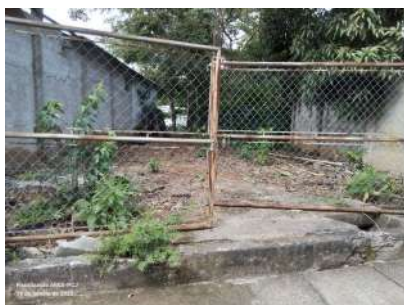
Foto 1 - Entrada da EEE
