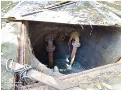
Foto 2 - Tubulações de recalque
