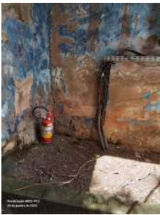
Foto 1 - Extintor de incêndio
