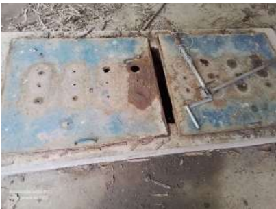
Foto 1 - Tampa em estado de deterioração 1
