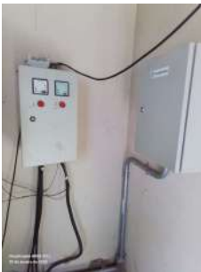
Foto 2 - Painéis elétricos das bombas
