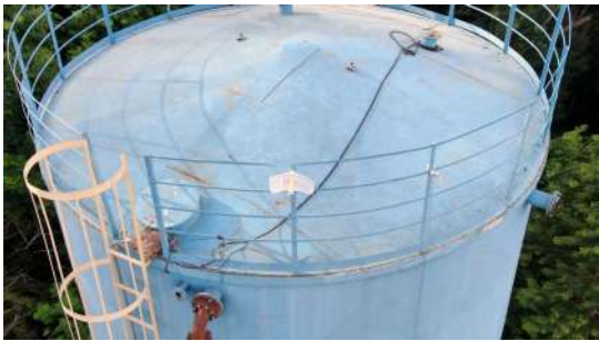
Foto 1 - Tubo extravasor sem tela de proteção
