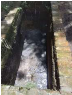
Foto 3 - Caixa com acúmulo de sedimentos 2
