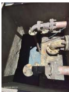
Foto 1 - Tubulações de recalque
