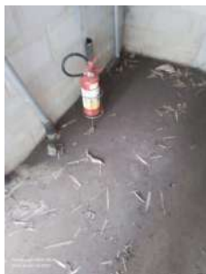
Foto 1 - Extintor de incêndio
