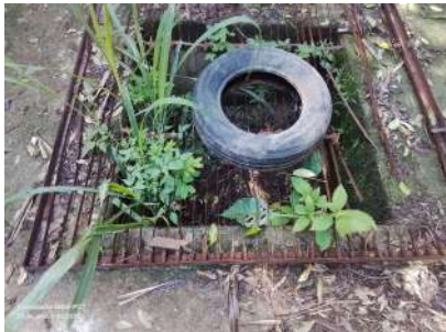
Foto 2 - Grade com avaria
