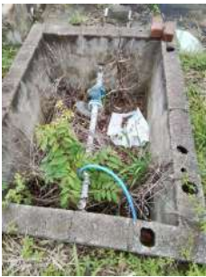
Foto 2 - Limpeza necessária no local
