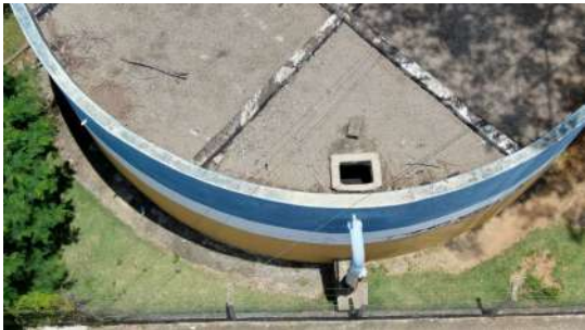
Foto 1 - Reservatório sem tampa de inspeção
