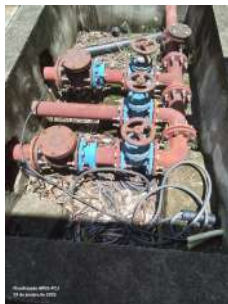
Foto 5 - Válvulas de manobra
