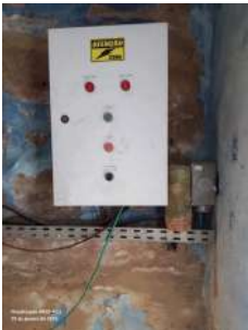
Foto 3 - Painel elétrico da bomba
