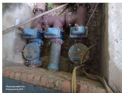
Foto 2 - Válvulas de manobra
