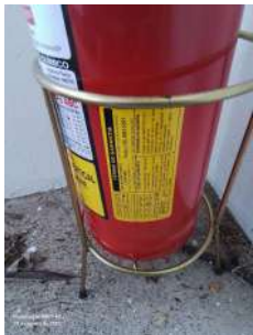
Foto 1 - Etiqueta de validade do extintor de incêndio
