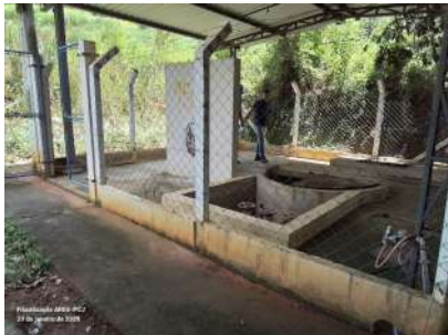
Foto 1 - Vista externa da EEE
