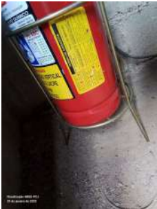
Foto 1 - Etiqueta de validade do extintor de incêndio
