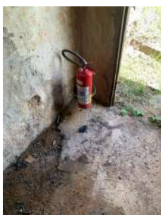
Foto 1 - Extintor de incêndio
