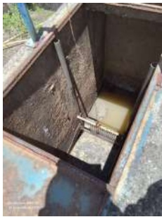
Foto 1 - Grade com avaria.
