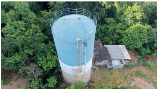
Foto 1 - Ausência de para-raios
