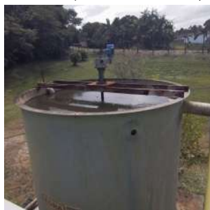
Foto 11 - Tanques da ETA em Ipeúna
