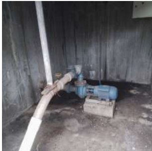
Foto 3 - Bomba da Estação elevatória de esgoto Centro em Ipeúna
