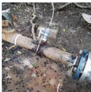
Foto 1 - Vazamento na tubulação da Captação subterrânea Poço 1 em Ipeúna
