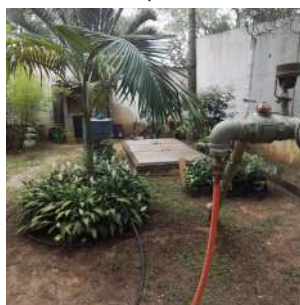
Foto 5 - Tomada de água da Captação subterrânea 4 em Ipeúna
