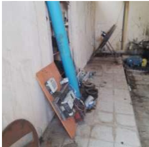
Foto 1 - Ausência de limpeza e organização do Estação elevatória de água do Reservatório Semi-enterrado em Ipeúna
