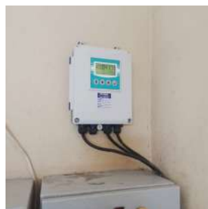
Foto 2 - Macro medidor de vazão da ETA em Ipeúna
