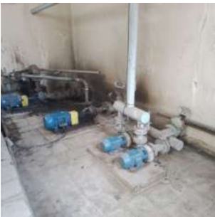
Foto 2 - Estação elevatória de água do Reservatório Semi-enterrado em Ipeúna
