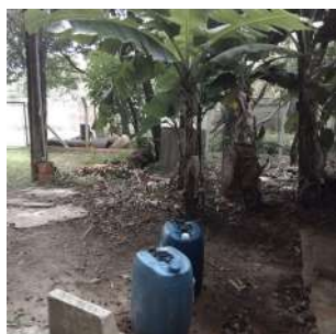
Foto 5 - Captação subterrânea Poço 1 em Ipeúna
