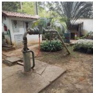
Foto 2 - Captação subterrânea 4 em Ipeúna
