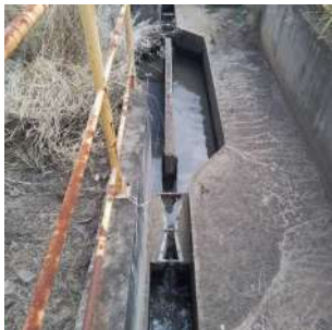
Foto 1 - Calha Parshall na entrada da ETE em Ipeúna
