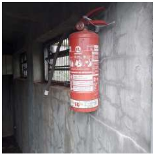
Foto 2 - Extintor de incêndio vencido da Estação elevatória de esgoto Centro em Ipeúna
