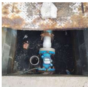
Foto 1 - Macro medidor de vazão da ETA em Ipeúna
