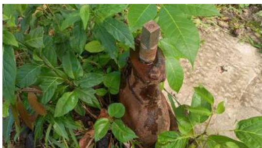
Foto 1 - Vazamento no Reservatório elevado 4 em Ipeúna
