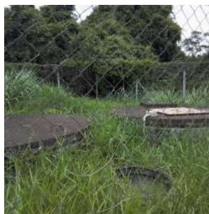
Foto 4 - Elevatória de Esgoto Alto de Ipeúna em Ipeúna
