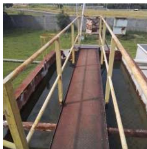
Foto 10 - Tanques da ETA em Ipeúna
