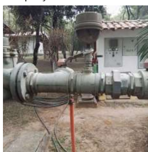
Foto 3 - Manômetro da Captação subterrânea 4 em Ipeúna
