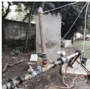
Foto 1 - Captação subterrânea Poço 1 em Ipeúna
