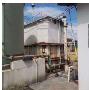
Foto 3 - Dosagem de produtos químicos da ETA em Ipeúna
