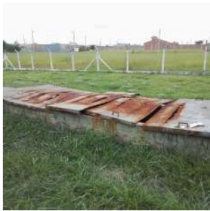
Foto 2 - Elevatória de Esgoto RESIDENCIAL ZILDA SCAGLIA DORTA em Ipeúna
