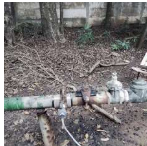
Foto 2 - Vazamento na tubulação da Captação subterrânea Poço 1 em Ipeúna
