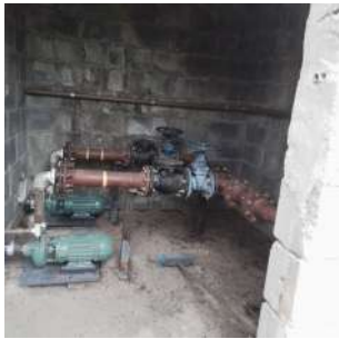
Foto 5 - Bombas da Elevatória de Esgoto RESIDENCIAL ZILDA SCAGLIA DORTA em Ipeúna
