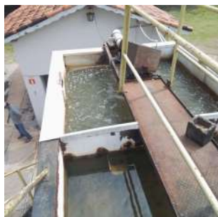
Foto 9 - Tanques da ETA em Ipeúna
