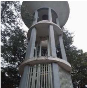
Foto 1 - Reservatório 2 - Castelo em Ipeúna
