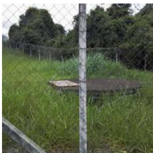
Foto 5 - Elevatória de Esgoto Alto de Ipeúna em Ipeúna
