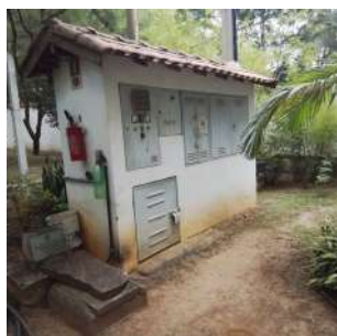
Foto 4 - Painel elétrico da Captação subterrânea 4 em Ipeúna
