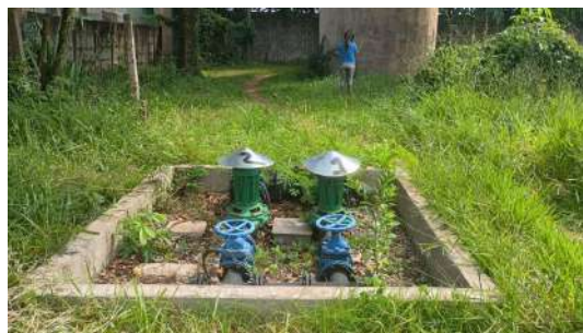
Foto 12 - Boosters desativados do Reservatório elevado 4 em Ipeúna
