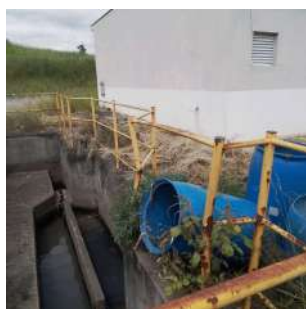
Foto 1 - Guarda-corpos enferrujados e quebrados na ETE em Ipeúna
