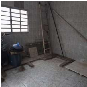
Foto 1 - Ausência de limpeza do Reservatório semi-enterrado da ETA em Ipeúna
