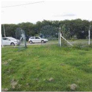
Foto 1 - Entrada da Elevatória de Esgoto RESIDENCIAL ZILDA SCAGLIA DORTA em Ipeúna
