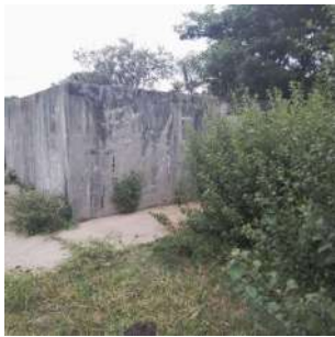
Foto 1 - Estação elevatória de esgoto Centro em Ipeúna
