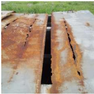
Foto 1 - Condição insegura da Elevatória de Esgoto RESIDENCIAL ZILDA SCAGLIA DORTA em Ipeúna
