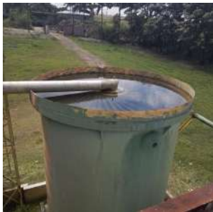
Foto 1 - Tanques enferrujados da ETA em Ipeúna
