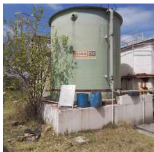
Foto 1 - Tanque de produtos químicos da ETA em Ipeúna
