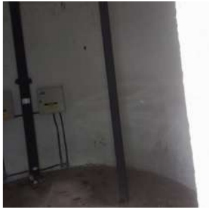
Foto 5 - Tubulações de entrada e saída do Reservatório elevado 4 em Ipeúna
