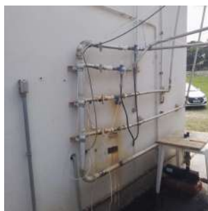
Foto 8 - Dosagem de produtos químicos da ETA em Ipeúna
