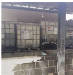
Foto 14 - Estocagem de produtos químicos da ETA em Ipeúna
