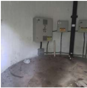
Foto 4 - Pannel elétrico do Reservatório elevado 4 em Ipeúna
