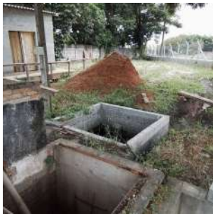
Foto 1 - Ausência de segurança e limpeza Estação elevatória de esgoto de Nova Ipeúna em Ipeúna
