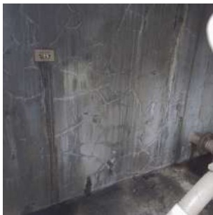
Foto 1 - Vazamento na parede da Estação elevatória de esgoto Centro em Ipeúna
