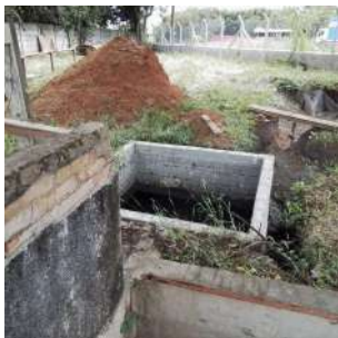
Foto 7 - Estação elevatória de esgoto de Nova Ipeúna em Ipeúna
