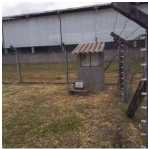
Foto 2 - Painele elétrica da Elevatória de esgoto Jardim dos Ipês em Ipeúna
