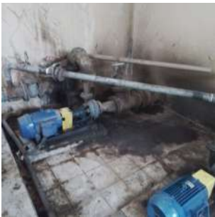
Foto 1 - Estação elevatória de água do Reservatório Semi-enterrado em Ipeúna
