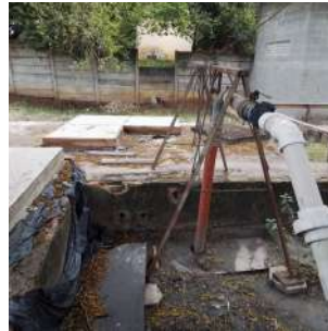
Foto 6 - Estação elevatória de esgoto de Nova Ipeúna em Ipeúna
