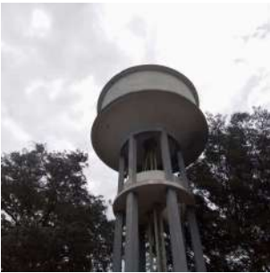
Foto 4 - Reservatório 2 - Castelo em Ipeúna
