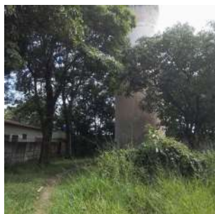
Foto 1 - Ausência de limpeza no Reservatório elevado 4 em Ipeúna
