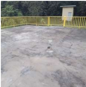
Foto 2 - Tubulação de ventilação do Reservatório semi-enterrado da ETA em Ipeúna
