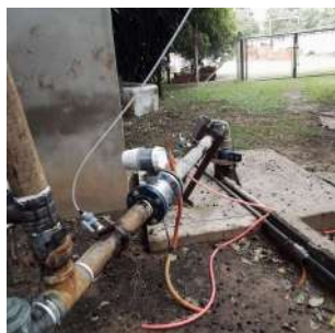
Foto 3 - Medidor de vazão da Captação subterrânea Poço 1 em Ipeúna
