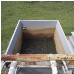
Foto 2 - Tanques enferrujados da ETA em Ipeúna
