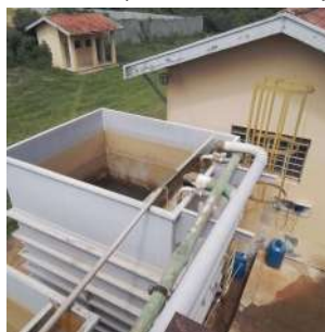
Foto 12 - Tanques da ETA em Ipeúna
