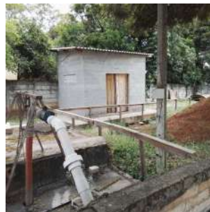
Foto 8 - Estação elevatória de esgoto de Nova Ipeúna em Ipeúna
