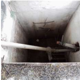
Foto 5 - Estação elevatória de esgoto de Nova Ipeúna em Ipeúna
