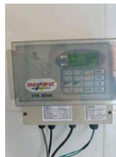
Foto 4 - Macromedidor de entrada
