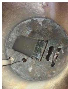
Foto 1 - Cesto obstruído de sujeira
