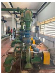
Foto 3 - Vista dos conjuntos moto-bombas
