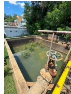
Foto 4 - Tratamento de lodo paralisado
