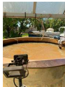
Foto 2 - Entrada de água bruta
