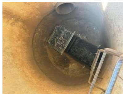
Foto 2 - Poço de gradeamento
