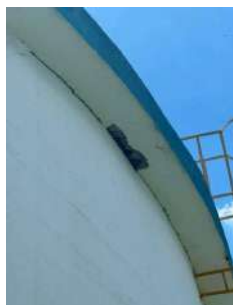
Foto 5 - Perda do revestimento
