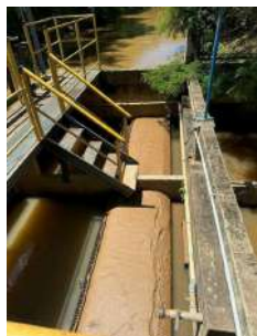
Foto 1 - Ausência de limpeza do gradeamento
