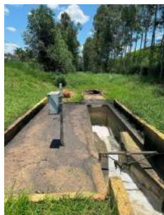
Foto 7 - Canal de saída de esgoto tratado
