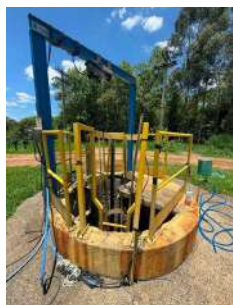
Foto 11 - Elevatória de esgoto bruto
