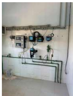
Foto 11 - Sala de medição
