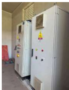
Foto 5 - Sala de painéis
