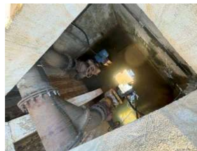
Foto 12 - Bombas da EEEB
