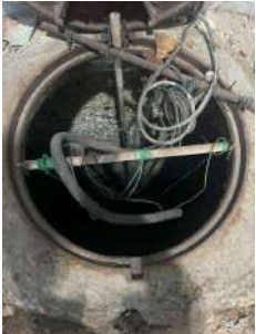
Foto 3 - Poço de gradeamento
