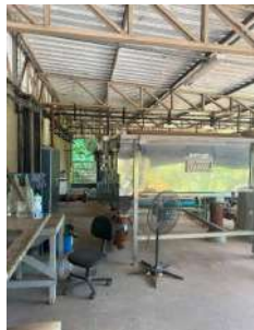
Foto 3 - Tratamento de lodo ETA
