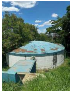
Foto 1 - Ausência de limpeza
