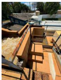
Foto 1 - Guarda-corpos e pisos oxidados
