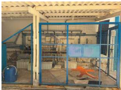
Foto 1 - Sala de bombas dosadoras em condições precárias
