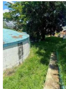
Foto 2 - Ausência de limpeza
