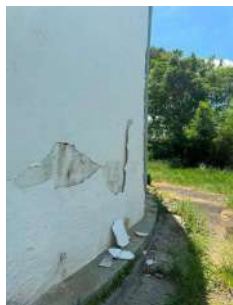
Foto 3 - Descamação da parede indicando presença de umidade
