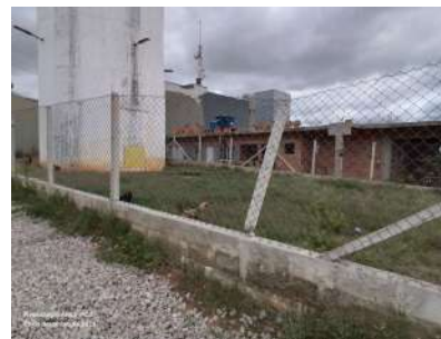
Foto 2 - Alambrado tombado. Faz-se necessária a manutenção do alambrado.
