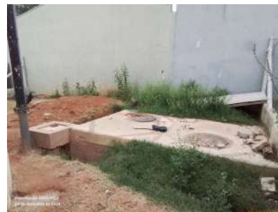
Foto 2 - Mato no entorno do reservatório.
