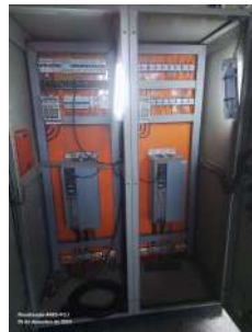
Foto 5 - Painel elétrico aberto.
