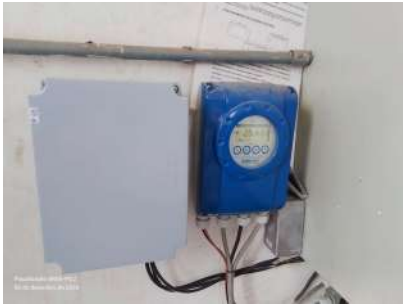
Foto 4 - Macromedidor de entrada do reservatório.
