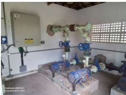
Foto 1 - Duas motobombas operando ao mesmo tempo. Providenciar e instalar terceiro conjunto motobomba reserva.
