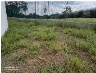
Foto 3 - Mato no entorno do reservatório. Faz-se necessária a roçagem do mato.
