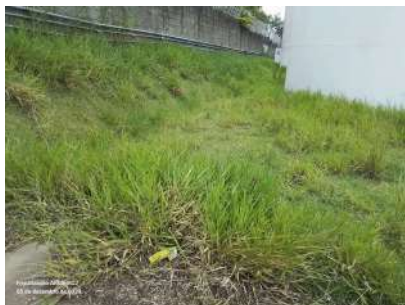
Foto 1 - Mato no entorno do reservatório.
