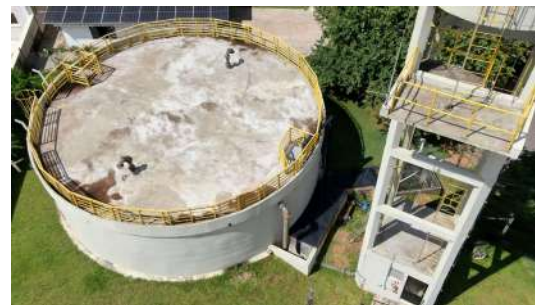
Foto 2 - Guarda-corpo sobre o reservatório.
