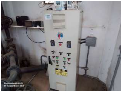
Foto 3 - Painel elétrico da EEAT.
