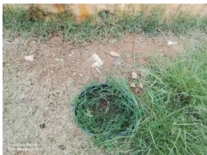
Foto 3 - Cabo de aterramento.
