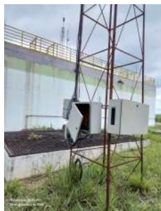
Foto 3 - Pannel elétrico danificado e com fiação exposta. Faz-se necessária a manutenção do pannel e proteção dos fios com eletroduto.
