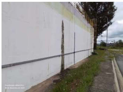
Foto 1 - Vazamento aparente na parede do reservatório.
