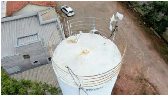
Foto 1 - Ausência de para-raios.
