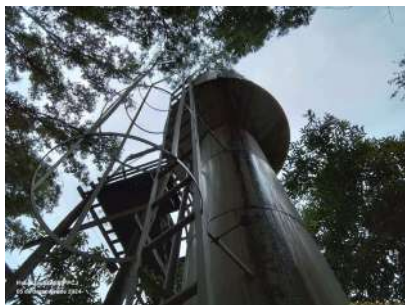
Foto 1 - Cabo de aterramento inexistente.
