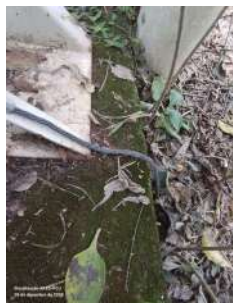
Foto 3 - Cabo de aterramento.
