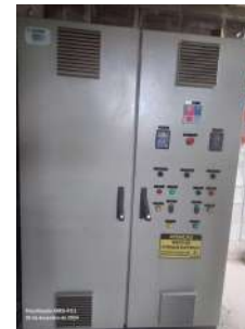
Foto 4 - Painel elétrico fechado.
