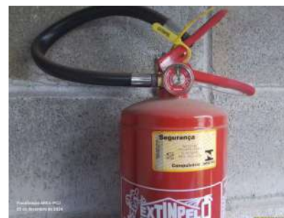
Foto 2 - Manômetro indicando que o extintor está pressurizado.
