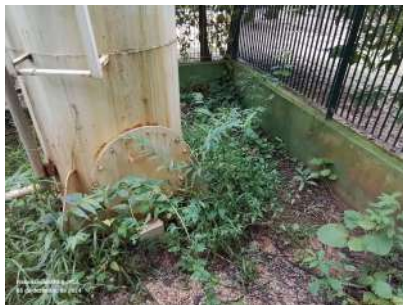
Foto 1 - Mato no entorno do reservatório.
