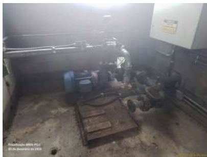
Foto 1 - Ausência de conjunto moto bomba reserva.
