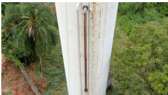
Foto 5 - Tubulação oxidada. Realizar a manutenção da tubulação.
