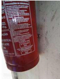
Foto 1 - Extintor de incêndio com validade expirada
