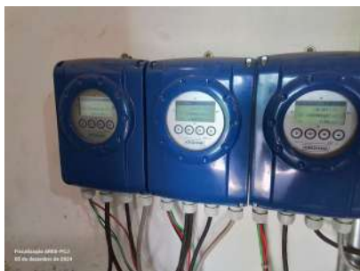
Foto 5 - Macromedidores de vazão.
