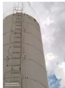
Foto 2 - Guarda-corpo solto no topo.
