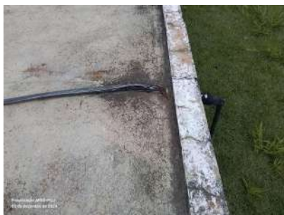
Foto 1 - Substituir eletroduto danificado.
