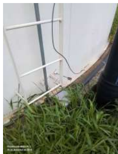
Foto 1 - Cabo de descarga rompido.
