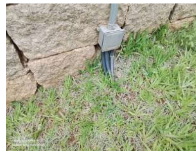
Foto 2 - Substituir e proteger eletroduto danificado.
