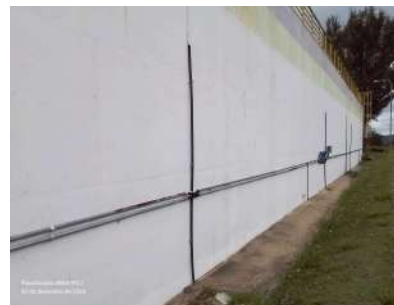
Foto 2 - Cabos de aterramento.
