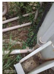
Foto 2 - Cabo de aterramento.
