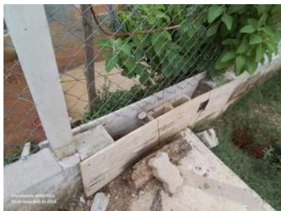
Foto 3 - Vão abaixo do alambrado. Faz-se necessária a manutenção do muro.
