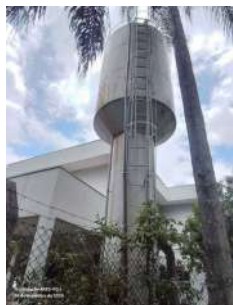
Foto 1 - Vazamento aparente na parede.
