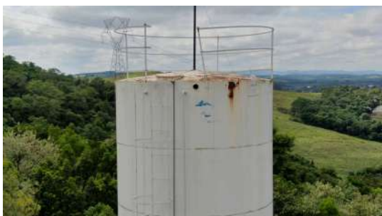
Foto 3 - Guarda-corpo solto no topo.
