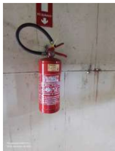
Foto 1 - Extintor de incêndio.
