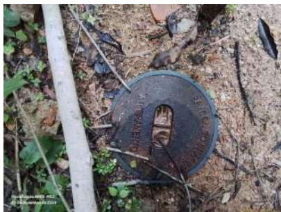
Foto 3 - Tampa da caixa de aterramento.
