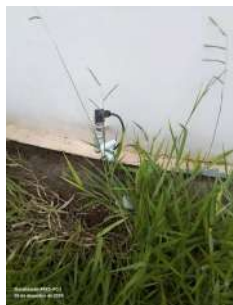
Foto 1 - Fio exposto a corte decorrente de roçagem. Recomenda-se o providenciamento da proteção do fio.
