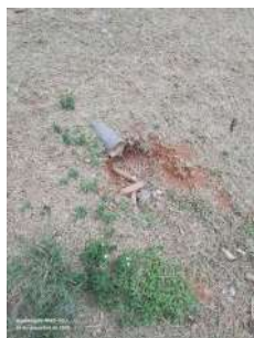
Foto 1 - Saída do tubo extravasor.
