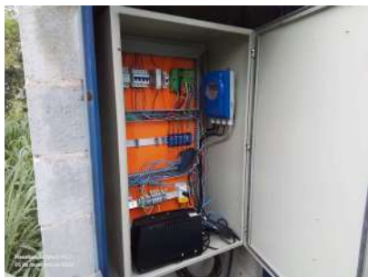
Foto 3 - Pannel elétrico aberto.
