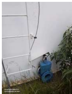
Foto 1 - Cabo de descarga rompido.
