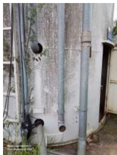
Foto 1 - Saída do tubo extravasor.
