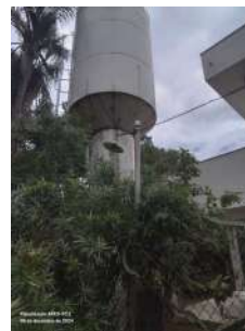
Foto 2 - Vazamento aparente na parede.
