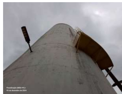
Foto 4 - Mancha de vazamento.
