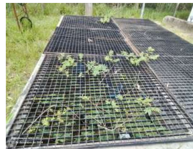
Foto 2 - Caixa da tubulação do reservatório. Faz-se necessária a limpeza do local.
