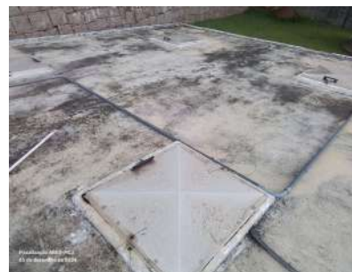
Foto 2 - Faz-se necessária a impermeabilização da laje.
