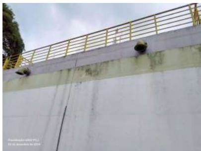
Foto 1 - Tubulações sem telas de proteção contra entrada de insetos e pequenos animais.
