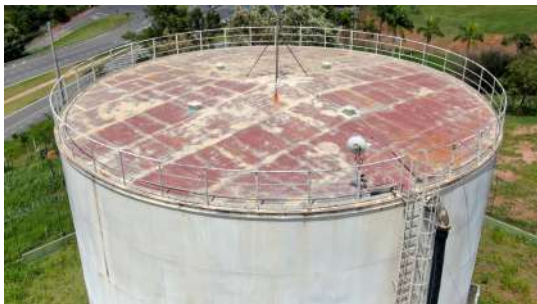
Foto 1 - Tubos de ventilação protegidos com tela.
