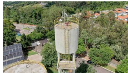
Foto 4 - Guarda-corpo do reservatório.
