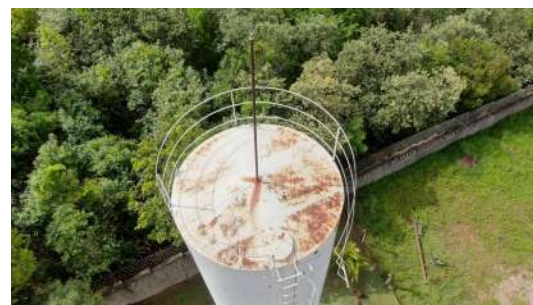
Foto 4 - Guarda-corpo solto no topo.
