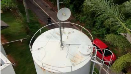
Foto 1 - Possíveis tubulações de ventilação sem proteção contra entrada de água pluvial.
