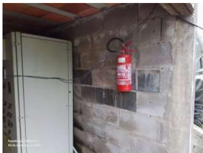
Foto 1 - Extintor de incêndio.
