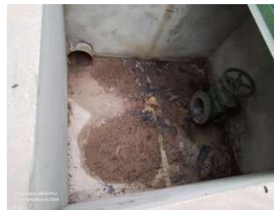
Foto 4 - Tubulação de descarte de fundo.
