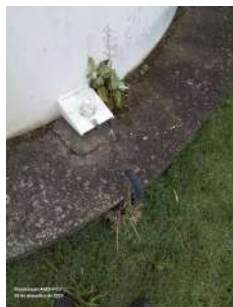
Foto 1 - Cabo de aterramento.
