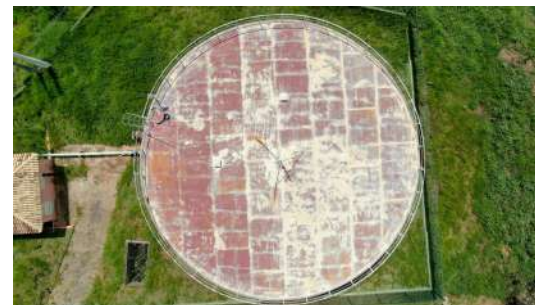
Foto 6 - Estrutura oxidando sem pintura.
