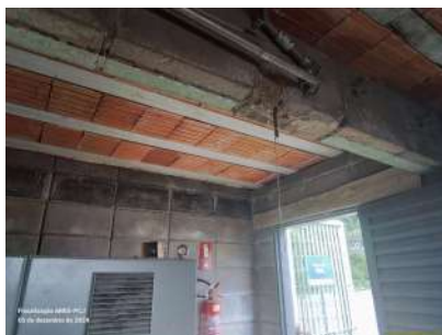
Foto 3 - Viga com armadura exposta.
