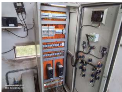
Foto 5 - Parte interna do painel elétrico.
