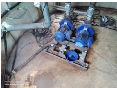
Foto 1 - Dois conjuntos motobomba, sendo um deles o reserva.
