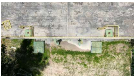
Foto 1 - Tampas com oxidação no topo.
