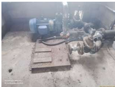
Foto 1 - Conjunto moto bomba.
