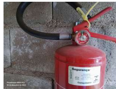
Foto 2 - Manômetro indicando que o extintor está pressurizado.
