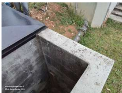
Foto 3 - Caixa que recebe a água do tubo extravasor.
