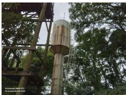
Foto 1 - Guarda-corpo do reservatório.
