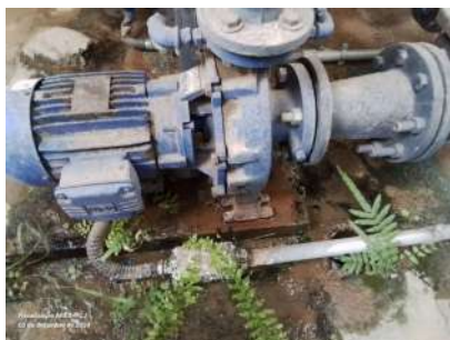
Foto 3 - Vazamento aparente na motobomba.
