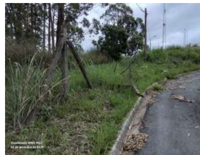
Foto 2 - Trecho com cerca danificada.
