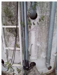
Foto 1 - Cabo de descarga rompido.
