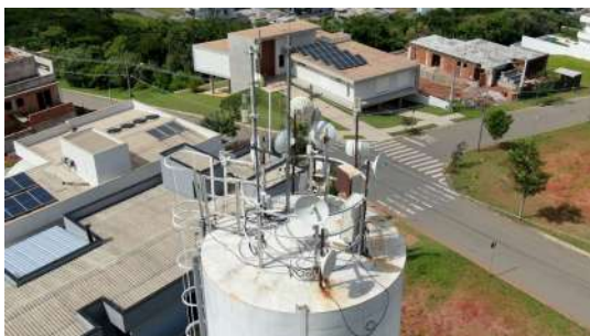
Foto 3 - Guarda-corpo sobre o reservatório.
