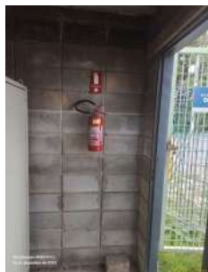
Foto 1 - Extintor de incêndio.
