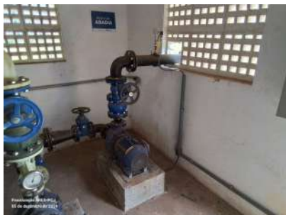
Foto 1 - Conjunto motobomba operando sem reserva.
