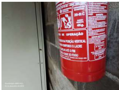
Foto 1 - Extintor de incêndio com validade expirada.
