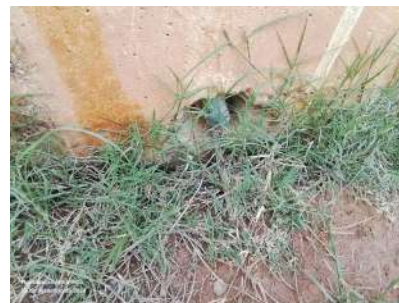
Foto 2 - Cabo de aterramento.
