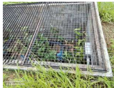
Foto 2 - Saída do reservatório com mato. Faz-se necessária a limpeza do local.
