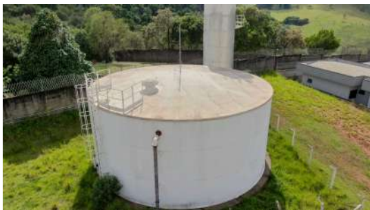
Foto 1 - Tubo de ventilação.
