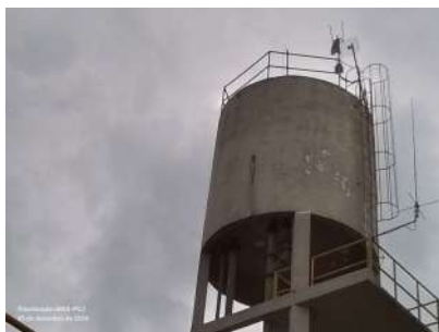
Foto 1 - Vazamento aparente na parede.
