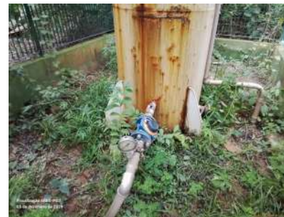
Foto 2 - Mato no entorno do reservatório.
