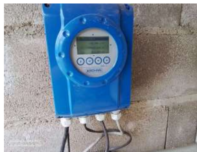
Foto 4 - Macromedidor de saída.
