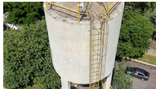
Foto 6 - Guarda-corpo do reservatório.
