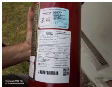
Foto 2 - Validade do extintor.
