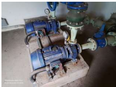
Foto 1 - Conjuntos motobomba com selo mecânico.
