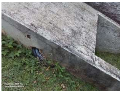
Foto 3 - Substituir e proteger eletroduto danificado.
