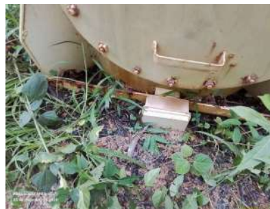
Foto 2 - Caixa de distribuição do sistema de aterramento.
