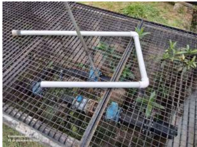
Foto 1 - Mato no interior da caixa de registros.
