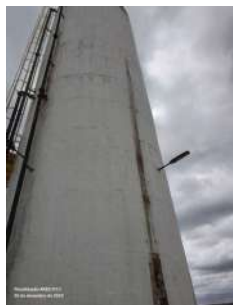
Foto 1 - Vazamento aparente na parede do reservatório.
