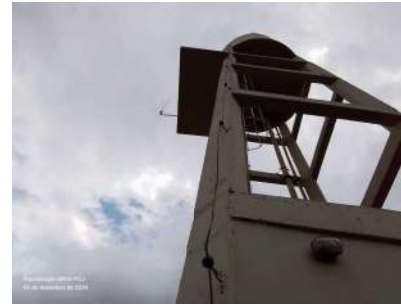
Foto 2 - Cabo de descarga elétrica.
