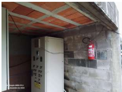
Foto 5 - Adequar a ligação elétrica.
