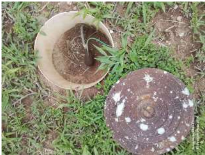
Foto 3 - Caixa de aterramento.
