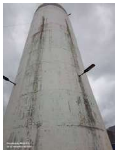
Foto 3 - Mancha de vazamento.
