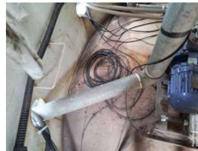
Foto 2 - Fiação espalhada na estação elevatória.
