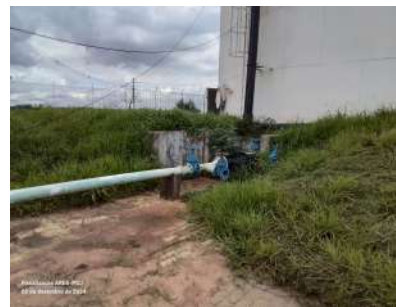
Foto 4 - Mato no entorno do reservatório. Faz-se necessária a roçagem do mato.
