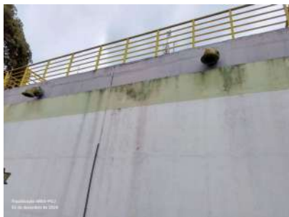
Foto 1 - Tubo extravasor sem tubo vertical de descida e caixa de coleta.
