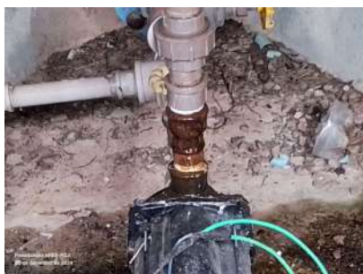
Foto 1 - Vazamento aparente e corrosão em peça do sistema.
