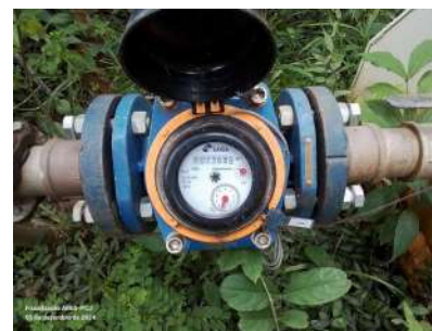
Foto 4 - Macromedidor de saída.
