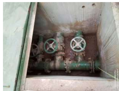
Foto 6 - Válvulas de manobra.
