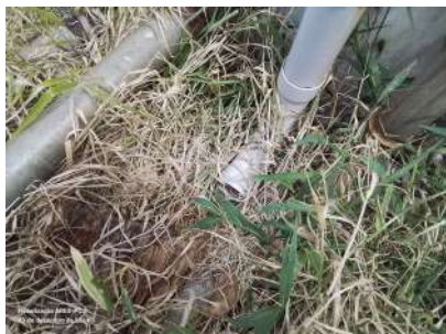
Foto 1 - Saída do tubo extravasor.
