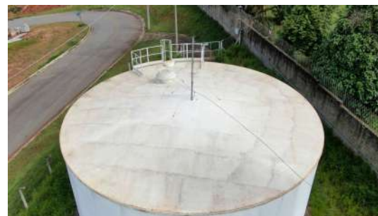
Foto 3 - Guarda-corpo do reservatório.
