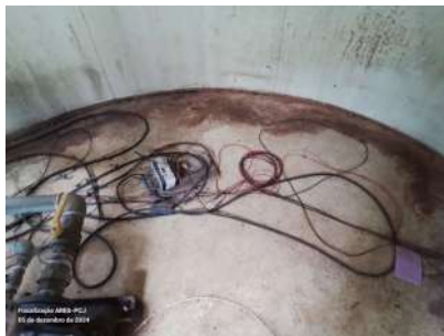
Foto 1 - Fiação espalhada na estação elevatória.
