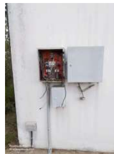
Foto 4 - Pannel elétrico sem a tampa, com a presença de oxidação e com fiação exposta. Faz-se necessária a manutenção do pannel.
