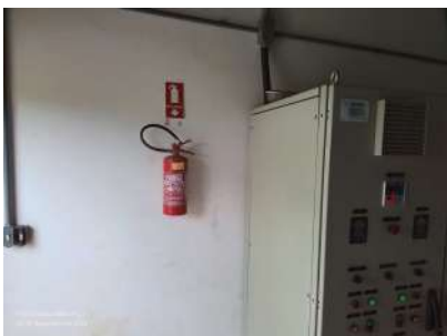
Foto 1 - Extintor de incêndio.
