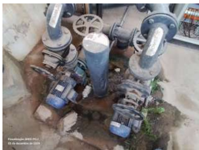
Foto 1 - Duas motobombas operando juntas. Falta o conjunto motobomba reserva.
