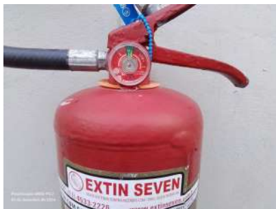
Foto 3 - Manômetro do extintor.
