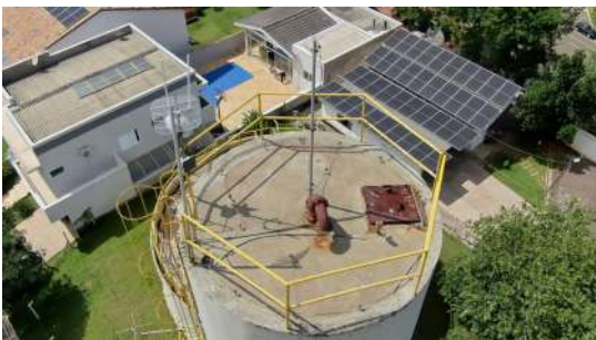
Foto 3 - Guarda-corpo do reservatório.
