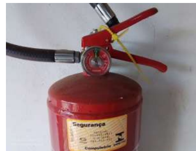
Foto 2 - Manômetro indicando que o extintor está pressurizado.
