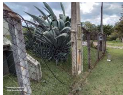
Foto 4 - Ligação elétrica fora do padrão. Cabo apoiado sobre o alambrado.
