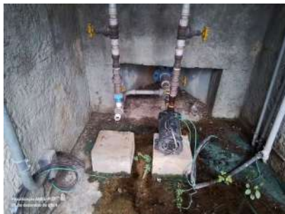
Foto 1 - A estação elevatória não possui conjunto motobomba reserva.
