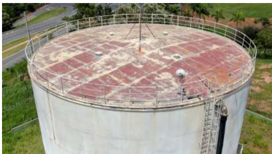
Foto 5 - Estrutura oxidando sem pintura.
