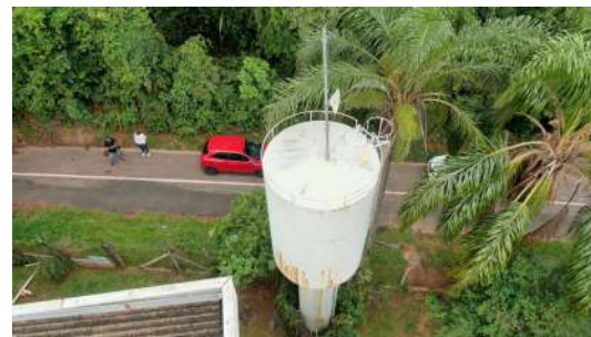
Foto 2 - Guarda-corpo no topo sem altura adequada.
