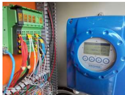
Foto 4 - CLP e Macromedidor de entrada.
