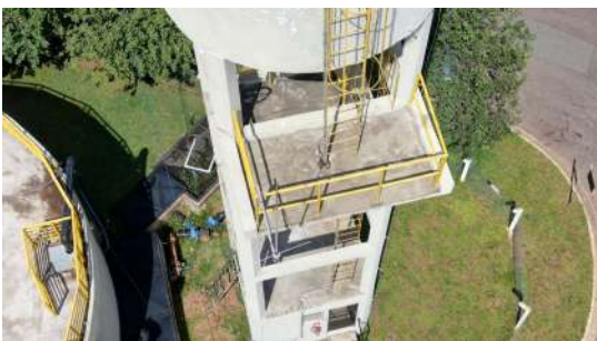
Foto 7 - Guarda-corpo do reservatório.
