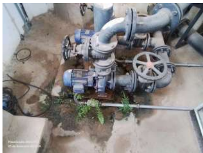
Foto 1 - Os dois conjuntos motobomba apresentam vazamento.
