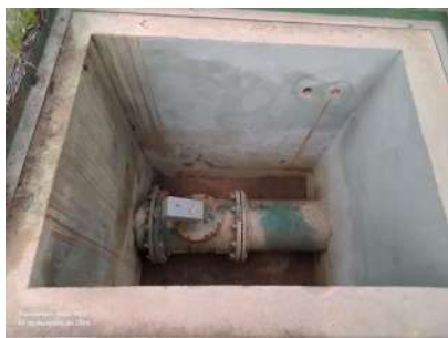
Foto 5 - Macromedidor de saída.
