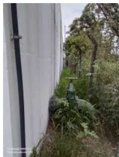
Foto 1 - Mato no entorno do reservatório. Faz-se necessária a roçagem do mato.
