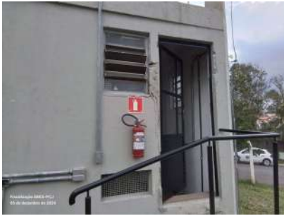
Foto 1 - Extintor de incêndio.
