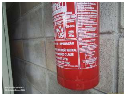
Foto 1 - Extintor com carga fora da validade.
