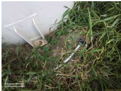
Foto 1 - Fiação exposta. Realizar a proteção da fiação contra corte provocado pela roçagem.
