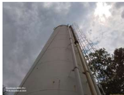
Foto 4 - Tubulação oxidada. Realizar a manutenção da tubulação.
