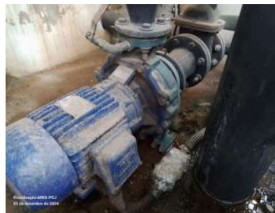
Foto 2 - Vazamento aparente na motobomba.
