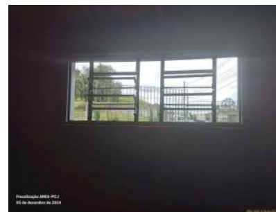
Foto 4 - Janelas sem vidro expondo o interior à ação da chuva.
