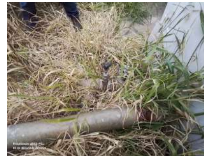
Foto 2 - Fiação exposta. Realizar a proteção da fiação contra corte provocado pela roçagem.
