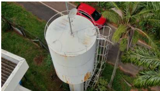
Foto 1 - Possíveis tubulações de ventilação sem tela de proteção.
