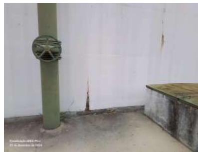
Foto 2 - Vazamento aparente na parede do reservatório.
