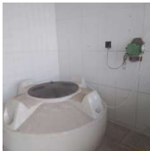
Foto 8 - Armazenamento de cloro
