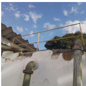
Foto 3 - Detalhe dos danos estruturais.
