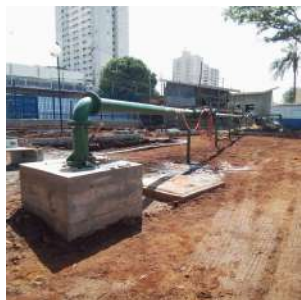
Foto 3 - Cavalete do poço 260 Lagoinha
