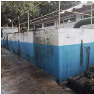
Foto 1 - Vista lateral da caixa de sucção
