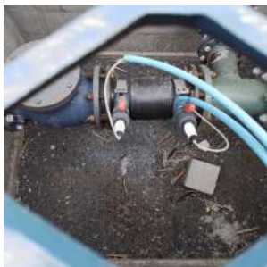
Foto 7 - Ponto de aplicação de cloro e flúor
