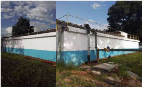
Foto 1 - Vista lateral da Caixa de Sucção do bairro Quintino.
