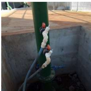
Foto 5 - Ponto de aplicação de cloro e flúor
