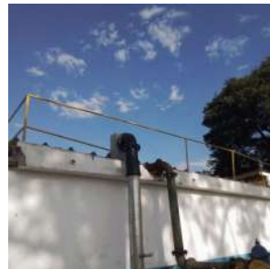
Foto 1 - Guarda-corpo danificado, com barras soltas.
