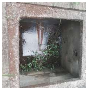
Foto 4 - Água acumulada na caixa de alvenaria próxima ao reservatório, contendo vazamento no TAP
