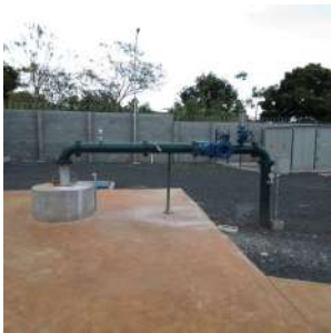
Foto 2 - Cavalete do poço 256 Paiva II
