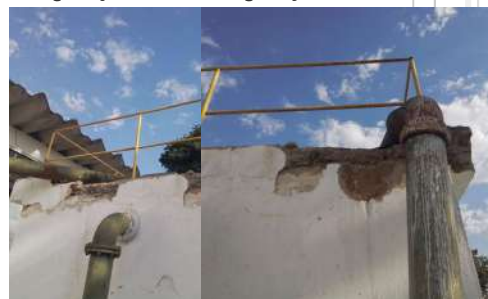
Foto 3 - Detalhe dos danos estruturais.
