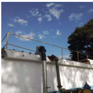
Foto 1 - Guarda-corpo danificado, com barras soltas.
