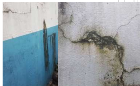
Foto 1 - Merejamento na parede frontal da caixa de sucção.
