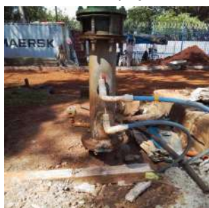
Foto 5 - Ponto de aplicação de cloro e flúor
