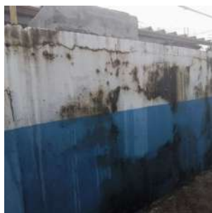
Foto 3 - Extensa exudação na parede do reservatório, indicando, possivelmente, falha na impermeabilização.
