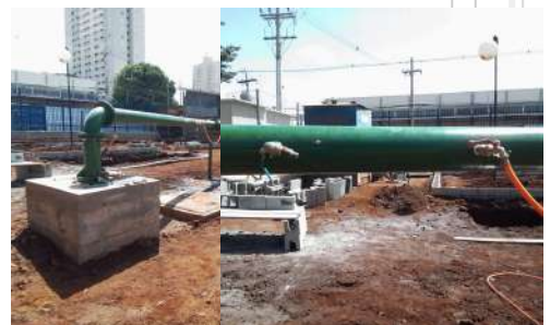
Foto 3 - Cavalete do poço 260 Lagoinha
