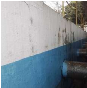
Foto 5 - Pontos de umidade visível na parede onde estão as tubulações de sucção.
