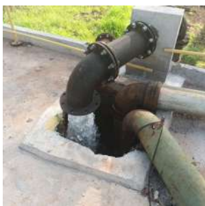
Foto 1 - Laje de entrada da água no reservatório sem fechamento adequado.
