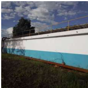
Foto 1 - Vista lateral da Caixa de Sucção do bairro Quintino.
