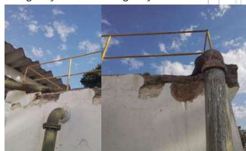
Foto 3 - Detalhe dos danos estruturais.
