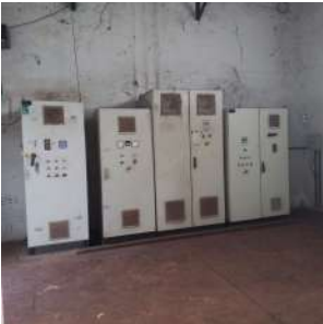
Foto 2 - Painel de Comando e Controle
