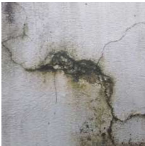
Foto 2 - Exudação aparente nas fissuras da parede da caixa de sucção.
