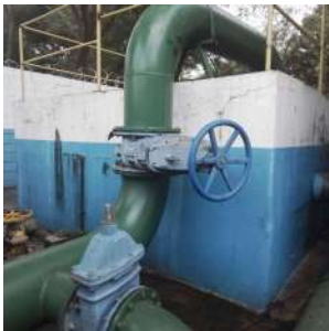
Foto 2 - Vista frontal da caixa de sucção
