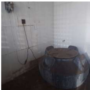
Foto 7 - Armazenamento de flúor
