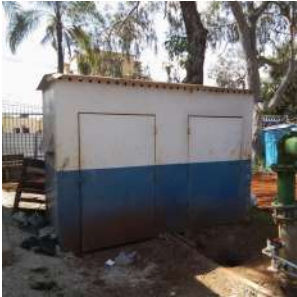
Foto 7 - Armazenamento de cloro e flúor
