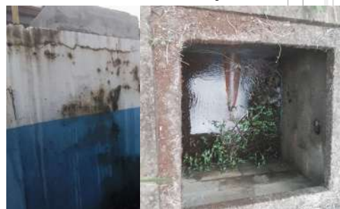
Foto 3 - Extensa exudação na parede do reservatório, indicando, possivelmente, falha na impermeabilizaçã o.
