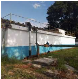
Foto 2 - Vista frontal da Caixa de Sucção do bairro Quintino.
