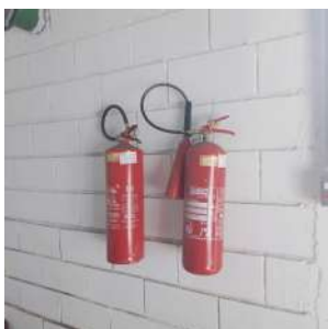
Foto 3 - Extintor de incêndio
