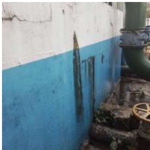
Foto 1 - Merejamento na parede frontal da caixa de sucção.
