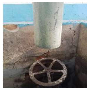
Foto 1 - Tubulação sem tela de proteção contra entrada de insetos e pequenos animais.
