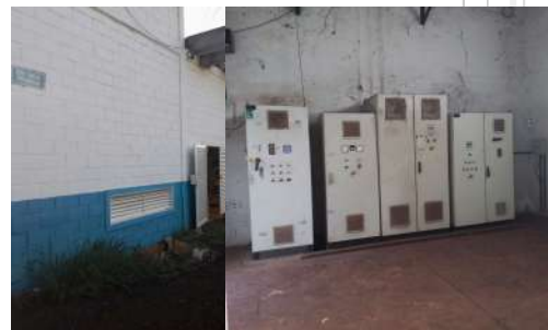
Foto 1 - Vista externa da EEAT Quintino Foto 2 - Painele de Comando e Controle
