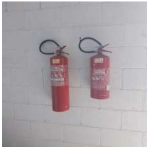
Foto 3 - Extintor de incêndio
