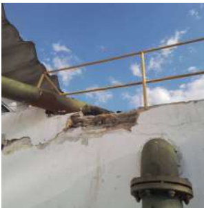
Foto 5 - Danos estruturais na junção entre a parede e a laje
