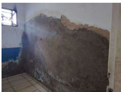
Foto 1 - Interior da EEAT Quintino
