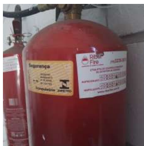
Foto 4 - Validade do extintor de incêndio
