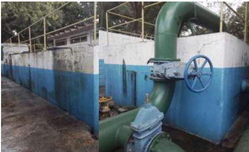
Foto 1 - Vista lateral da caixa de sucção
