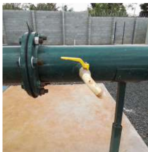
Foto 4 - Tomada para coleta de água
