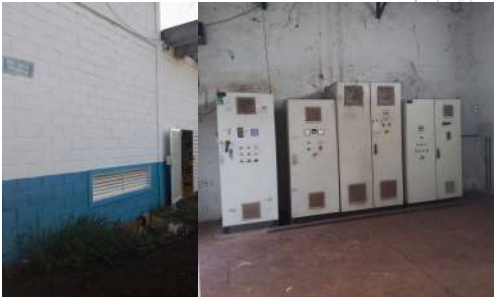
Foto 1 - Vista externa da EEAT Quintino Foto 2 - Painel de Comando e Controle
