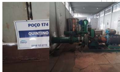
Foto 3 - Placa de identificação Foto 4 - Conjuntos motobombas
