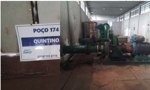
Foto 3 - Placa de identificação Foto 4 - Conjuntos motobombas
