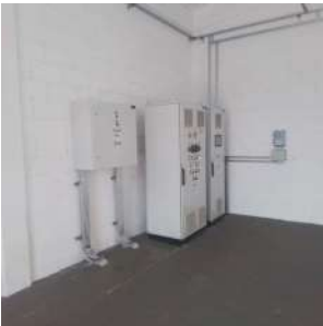
Foto 4 - Painele de comando e controle
