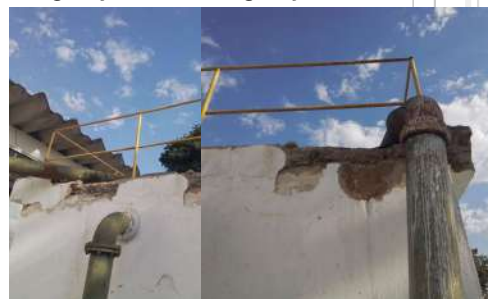
Foto 3 - Detalhe dos danos estruturais.
