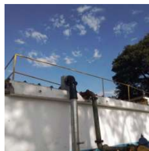
Foto 1 - Guarda-corpo danificado, com barras soltas.
