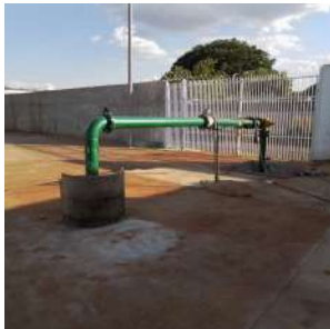
Foto 1 - Cavalete do poço Clubinho
