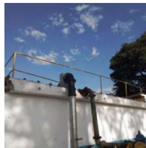
Foto 1 - Guarda-corpo danificado, com barras soltas.
