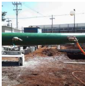
Foto 4 - Tomada para coleta de água
