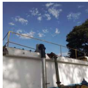
Foto 1 - Guarda-corpo danificado, com barras soltas.
