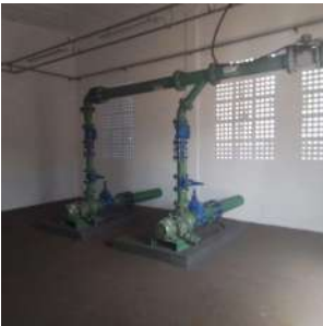
Foto 2 - Vista interna da EEAT Primavera
