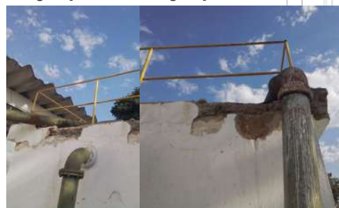
Foto 3 - Detalhe dos danos estruturais.
