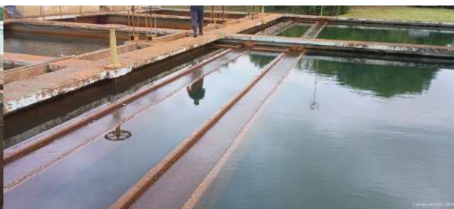
Foto 2 - Ausência de guarda-corpo em unidades de tratamento da ETA.
