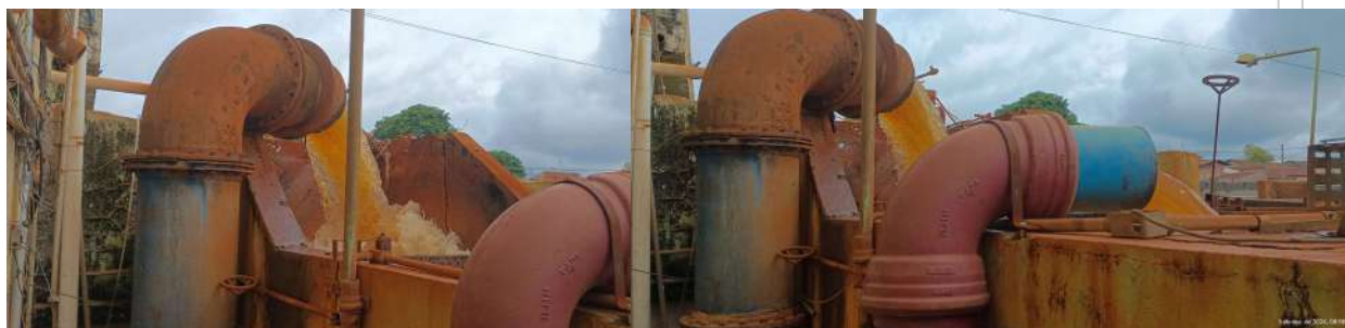
Foto 1 - Chegada da água bruta e do retorno da água do tanque de lodo. Dosagem de sulfato férrico e hidróxido de cálcio, e, futuramente, hipoclorito de sódio.
