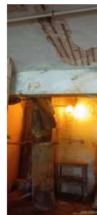
Foto 4 - Exposição de ferragem da estrutura abaixo dos floculadores.
