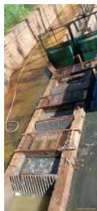
Foto 4 - Tratamento preliminar: gradeamento e caixa desarenadora.
