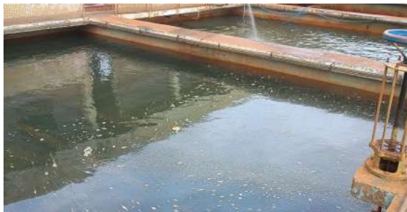
Foto 17 - Detalhe de um dos filtros.
