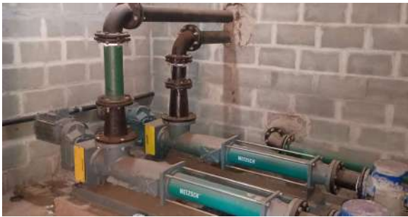
Foto 5 - Vista interna da EEE e dos conjuntos motobomba.
