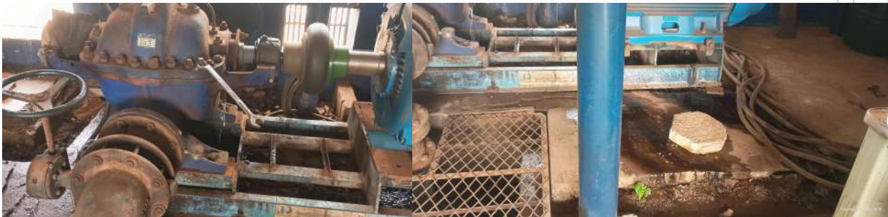
Foto 1 - Conjunto motobomba 1 com drenagem inadequada da água de gaxeta.
