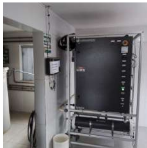
Foto 6 - Sistema de geração de hipoclorito de sódio.
