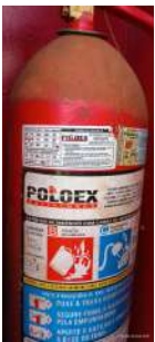
Foto 1 - Prazo de validade do extintor expirada.
