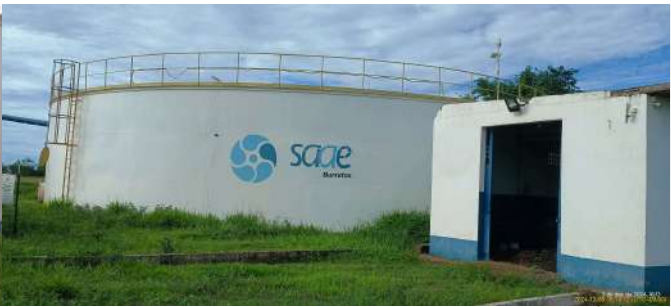
Foto 6 - EEAT e reservatório.
