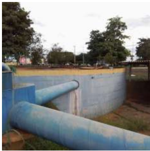
Foto 1 - Vazamento na lateral do reservatório, no ponto de chegada da adutora.
