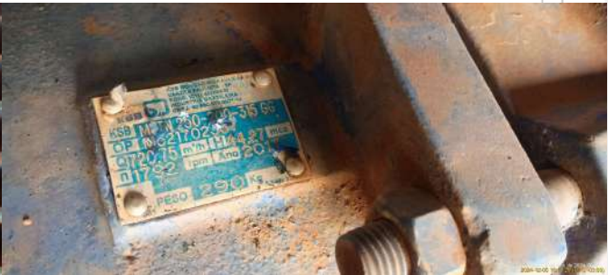
Foto 6 - Placa de especificações técnicas da bomba do conjunto.
