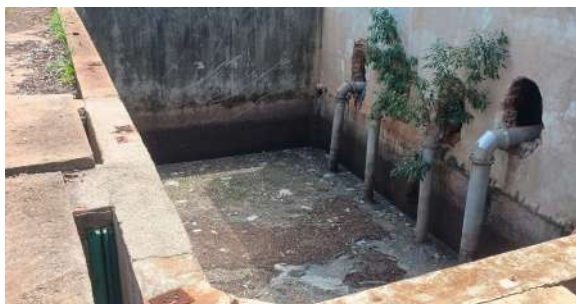
Foto 5 - Poço de sucção da elevatória.
