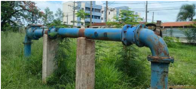
Foto 1 - Ausência de macromedidor no cavalete do poço.
