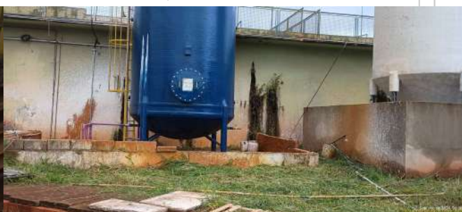
Foto 5 - Ausência de identificação do reservatório de hidróxido de cálcio e de bacia de contenção
