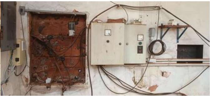
Foto 2 - Painel elétrico e de comando da EEAT.
