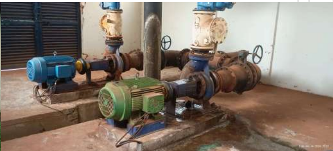
Foto 2 - Conjuntos motobomba da EEAT.
