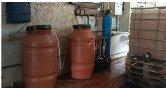
Foto 21 - Tanque e bombonas de armazenamento de produtos químicos.
