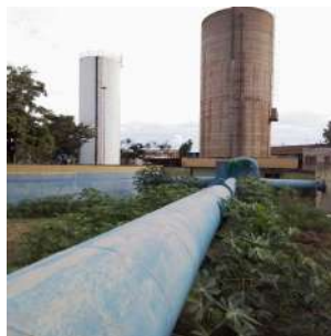
Foto 10 - Adutoras de abastecimento dos reservatórios semienterrados.
