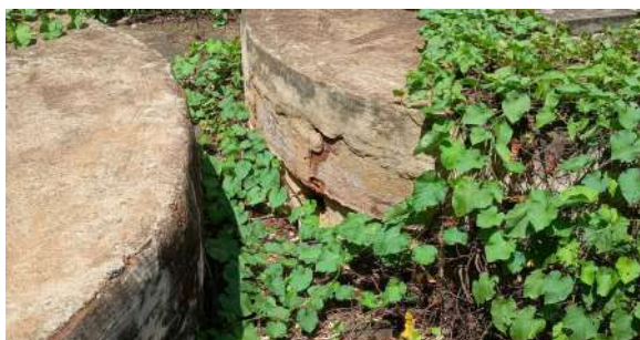
Foto 1 - Fissuras em um dos anéis de concreto.
