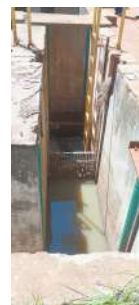
Foto 4 - Canal de gradeamento do lado direito, onde há o registro de bypass para lançamento de esgoto in natura do curso d'água.
