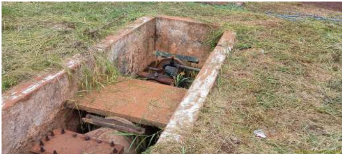
Foto 3 - Vazamentos na tubulação.
