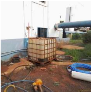
Foto 1 - Situação de tanque de produto químico na parte externa da casa de química do CR Barretos II.
