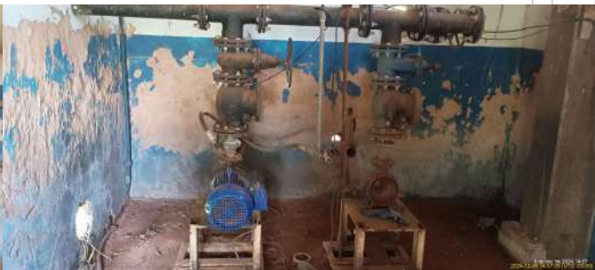
Foto 6 - Único conjunto motobomba instalado no local.
