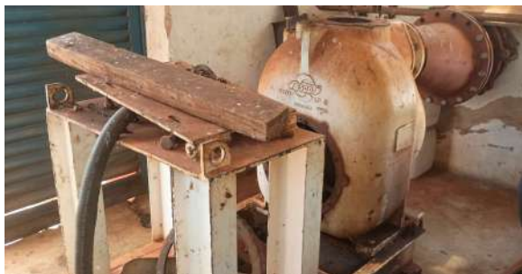
Foto 32 - Equipamento (bomba) inutilizado na estação.
