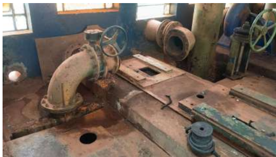
Foto 11 - Local de um quarto conjunto motobomba, sem equipamento no momento da fiscalização.
