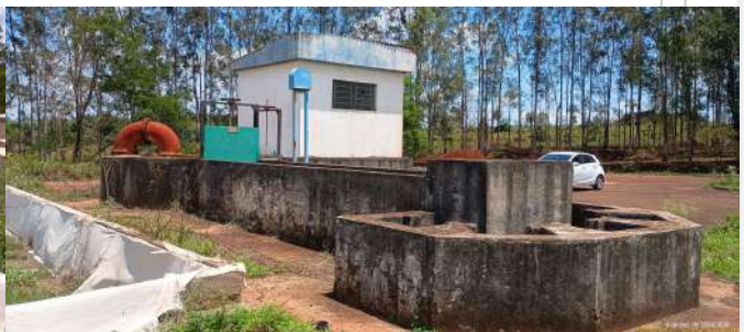
Foto 43 - Tanque de chegada do esgoto da segunda estação elevatória e, ao fundo, prédio da
