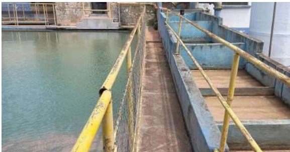
Foto 1 - Situação dos guarda-corpos entre floculadores e decantador.
