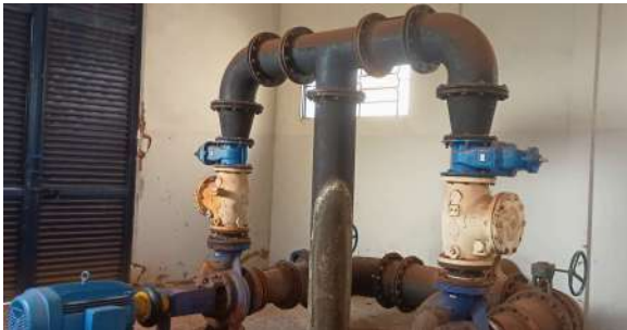
Foto 3 - Barrilete da EEAT.
