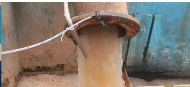
Foto 2 - Adutora de chegada da água bruta (Captação Aleixo) e dosagem de PAC.
