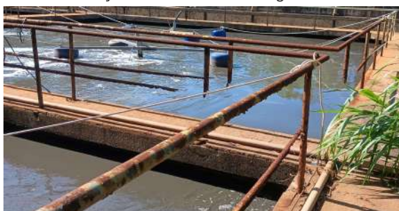
Foto 3 - Situação do guarda-corpo nos tanques de aeração.
