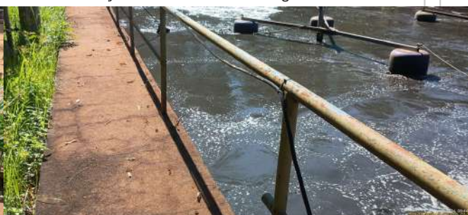
Foto 4 - Situação do guarda-corpo nos tanques de aeração.
