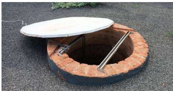
Foto 5 - Poço de chegada do esgoto e gradeamento.
