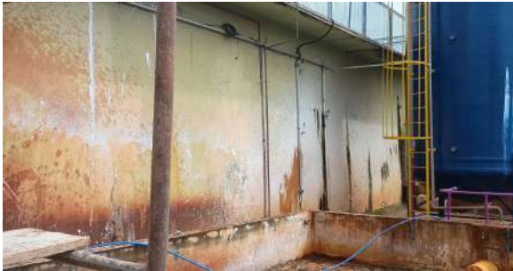
Foto 5 - Vazamentos nas laterais dos flocladores.
