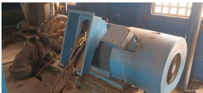
Foto 5 - Ausência da tampa da caixa de ligação elétrica do motor do conjunto 2 (esquerda).
