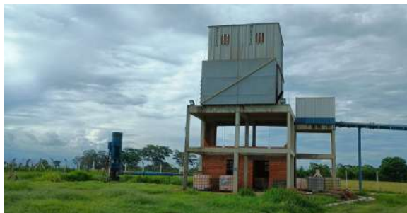
Foto 1 - Vista geral da área, com o poço à esquerda, sistema de resfriamento e dosagem de produtos químicos à direita.
