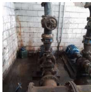
Foto 6 - Primeiro conjunto motobomba.
