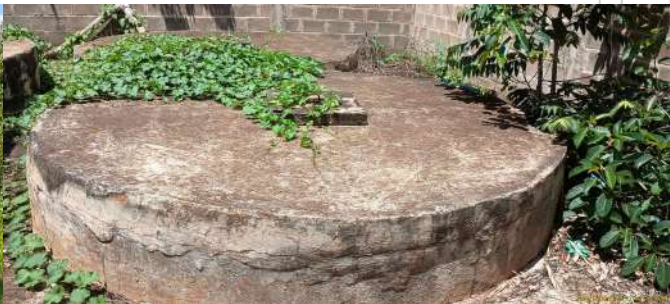
Foto 2 - Um dos tanques pulmão (acúmulo de esgoto).
