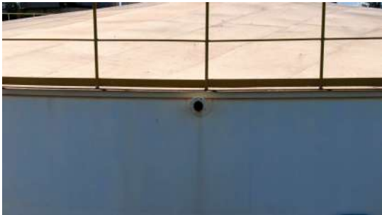
Foto 3 - Ausência de tela de proteção.
