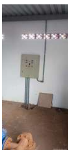
Foto 8 - Painel elétrico e de comando da EEE.
