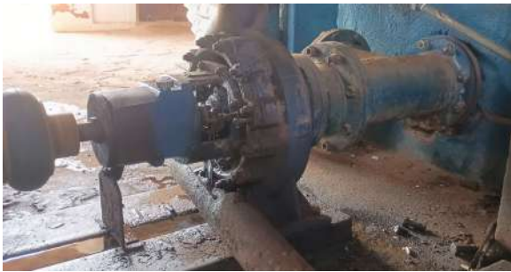
Foto 1 - Escoamento inadequado da água de lubrificação de gaxeta do conjunto 1.
