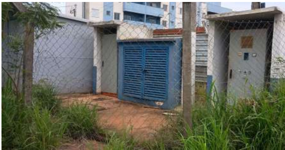
Foto 6 - Ausência de fechamento e isolamento da área dos painéis elétricos.
