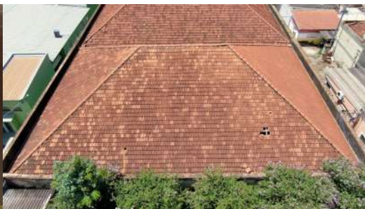
Foto 6 - Telhas quebradas no telhado do reservatório.
