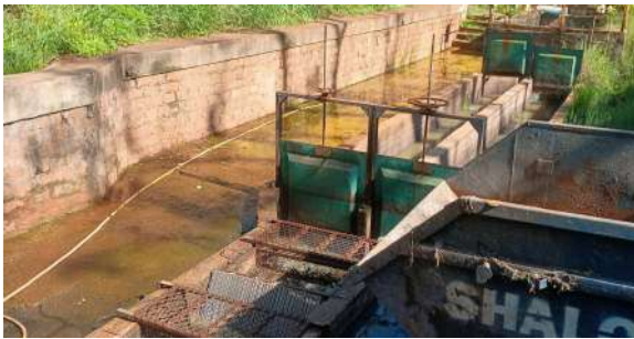
Foto 1 - Afloramento de água do subsolo no entorno do tratamento preliminar.
