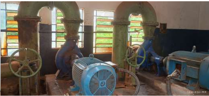
Foto 4 - Vista de 2 dos 3 conjuntos motobomba instalados.
