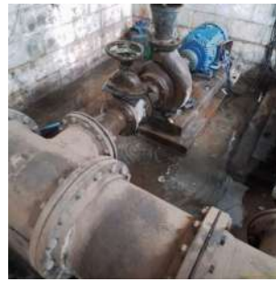
Foto 2 - Vazamento no registro da tubulação.
