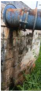
Foto 2 - Vazamento na lateral do reservatório, próximo à tubulação.
