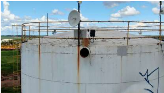
Foto 2 - Ausência de tela de proteção no tubo extravasor.
