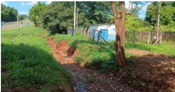
Foto 12 - Vista externa do local, com destaca para a erosão do solo entre a Rodovia e a EEE.
