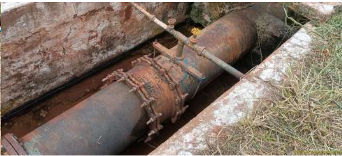
Foto 2 - Vazamentos na tubulação.
