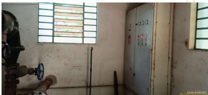
Foto 42 - Painel elétrico e de comando da elevatória.
