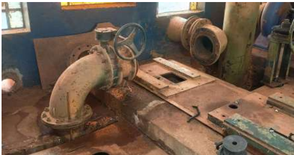
Foto 1 - Tubulação com vazamentos.
