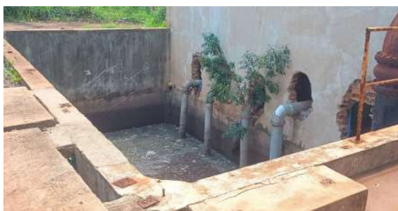
Foto 1 - Ausência de guarda-corpo.
