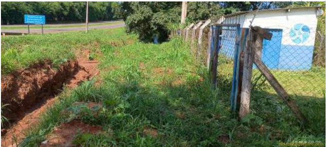
Foto 11 - Vista externa do local, com destaca para a erosão do solo entre a Rodovia e a EEE.
