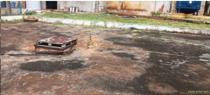
Foto 2 - Situação da laje do reservatório.
