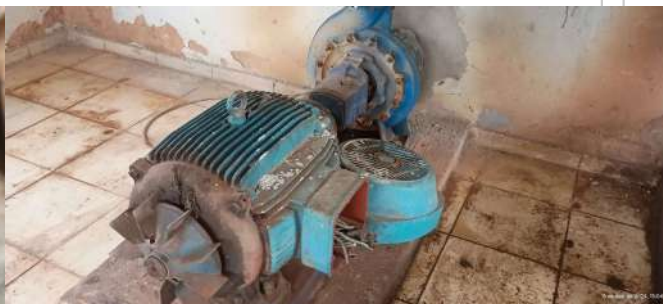
Foto 16 - Conjunto motobomba 2. Segundo informações os cabos elétricos foram furtados, porém o equipamento não apresenta avarias, estando operacional.
