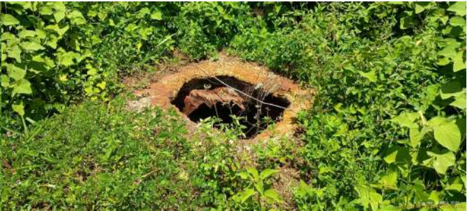
Foto 8 - Caixa de passagem entre lagoas com antiga tampa, aparentemente de madeira, porém inadequada e deteriorada.
