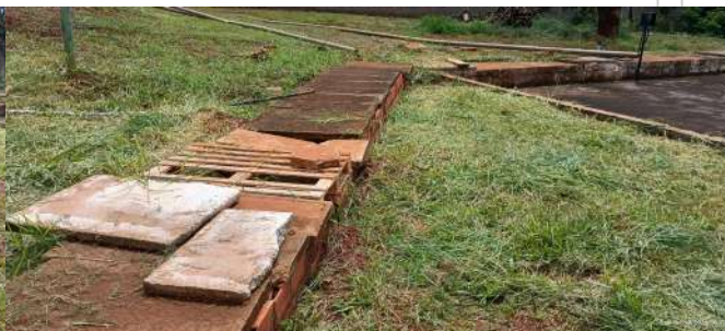
Foto 8 - Situação das tampas da canaleta de água tratada.
