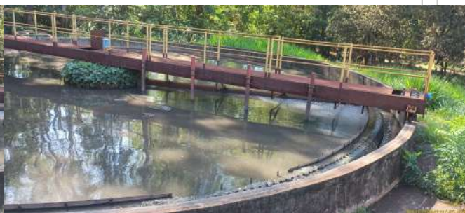
Foto 12 - Avarias no decantador 1.
