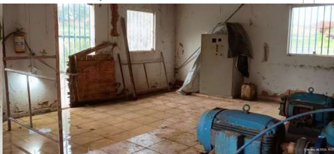
Foto 12 - Vista interna da casa de bombas.
