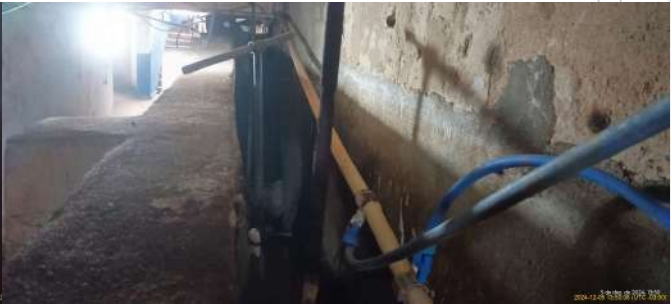
Foto 4 - Situação estrutural e de vazamentos abaixo dos filtros e cabos elétricos expostos.
