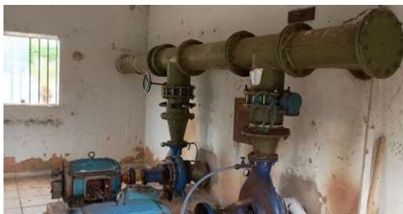
Foto 11 - Barrilete de adução da água bruta.
