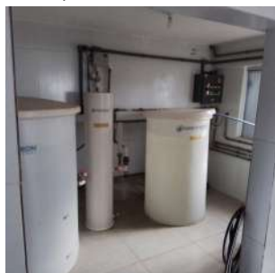
Foto 7 - Sistema de geração de hipoclorito de sódio.
