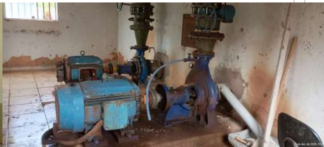
Foto 10 - Vista interna da casa de bombas e dos conjuntos motobomba.
