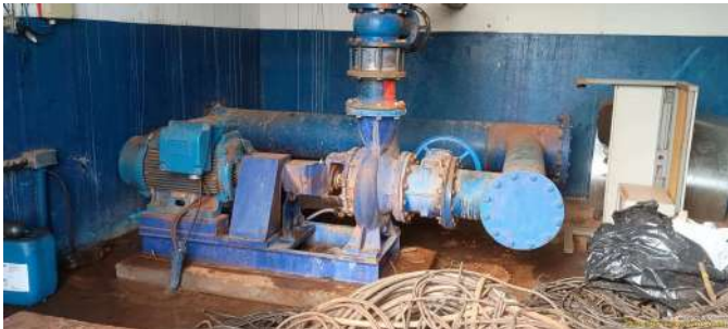
Foto 3 - Único conjunto motobomba da EEAT.
