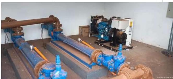
Foto 7 - Conjuntos motobomba da EEE e, à direita, conjunto gerador a diesel.
