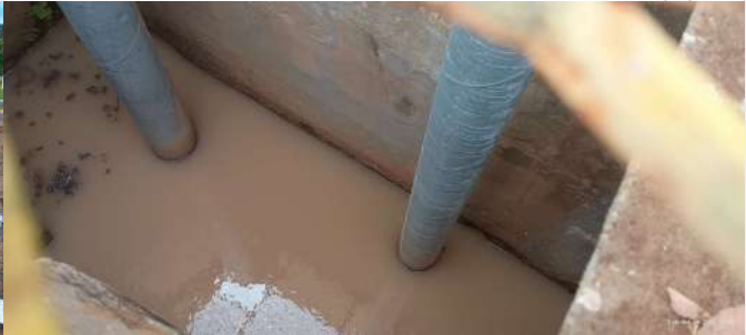
Foto 22 - Vista interna do poço de sucção de água bruta.
