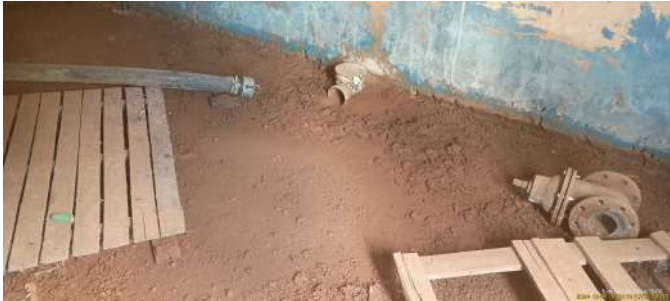
Foto 3 - Situação do piso no interior da EEE.
