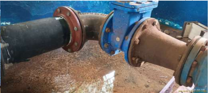
Foto 2 - Detalhe do vazamento na tubulação do equipamento 2.
