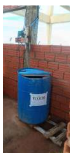
Foto 6 - Bombona de flúor e bomba dosadora.
