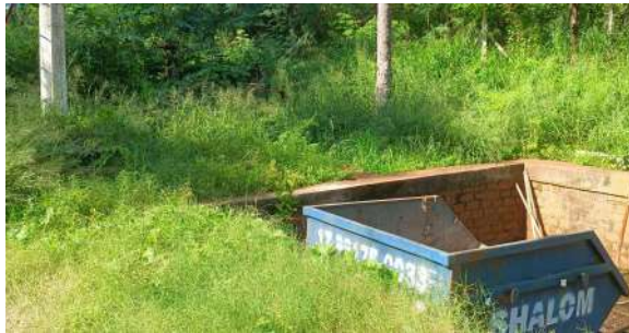
Foto 1 - Chegada do esgoto bruto e caçamba para remoção de materiais retidos no gradeamento.
