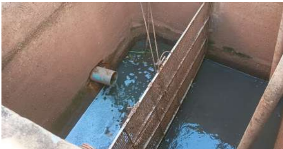
Foto 3 - Poço de chegada do esgoto, gradeamento e sucção.
