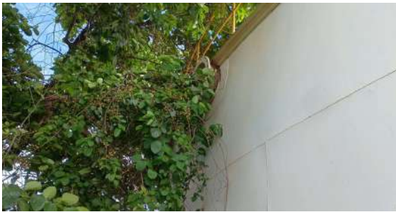
Foto 1 - Ausência de tela de proteção.
