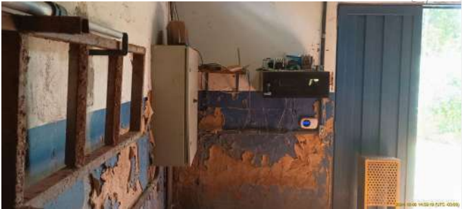
Foto 10 - Pannel elétrico e de comando da EEE.
