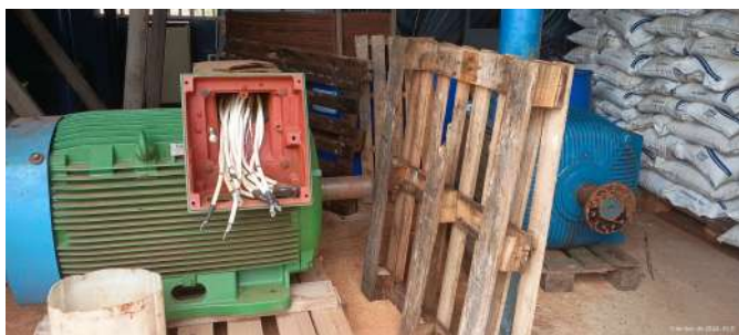
Foto 10 - Equipamentos reserva armazenados na EEAT.
