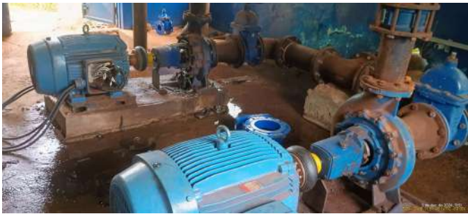
Foto 9 - Conjuntos motobomba da EEAT.
