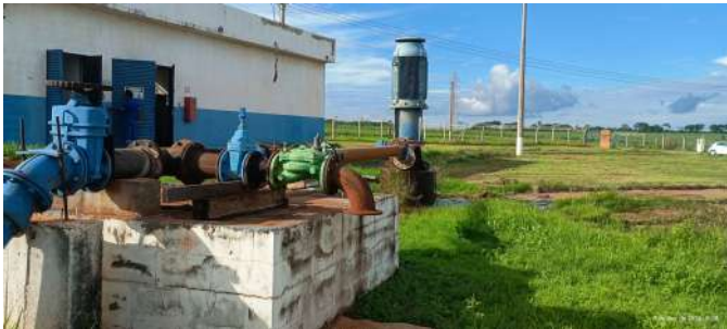
Foto 5 - Poço (frente) e abrigo dos transformadores e painéis elétricos.
