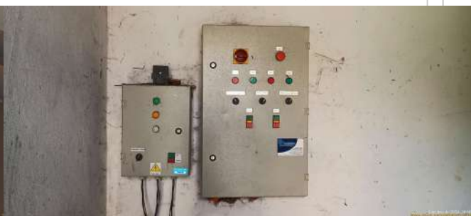
Foto 6 - Painéis elétricos e de comando.
