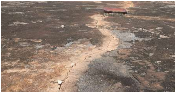
Foto 1 - Situação da laje do reservatório.
