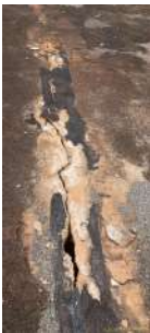
Foto 3 - Uma das rachaduras na laje do reservatório.
