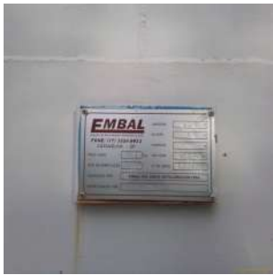
Foto 5 - Placa de especificações técnicas do reservatório.
