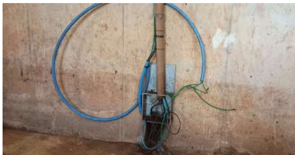
Foto 1 - Cabos e fios elétricos expostos.
