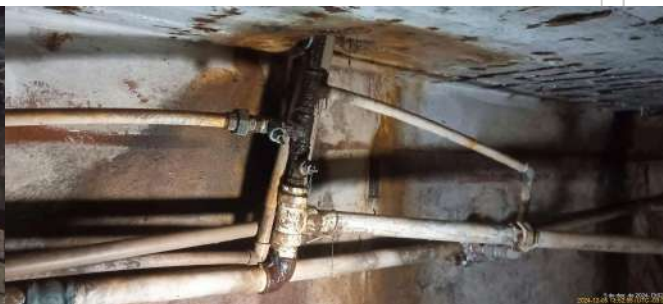
Foto 2 - Vazamentos e infiltrações na estrutura.
