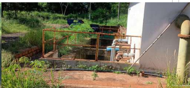
Foto 2 - Situação do guarda-corpo do tanque de sucção da elevatória de esgoto.
