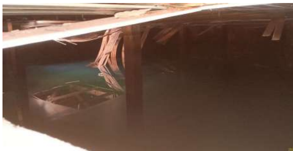
Foto 5 - Madeiramento da vedação quebrada e em contato com a água reservada.
