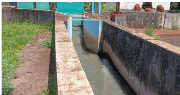
Foto 25 - Calha Parshall (sem gradação adequada) no canal de direcionamento do esgoto para a linha 1 de lagoas.
