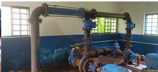
Foto 6 - Conjuntos motobomba da EEAT.
