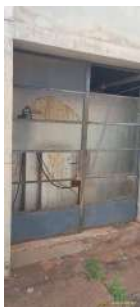
Foto 1 - Vidros da porta quebrados.
