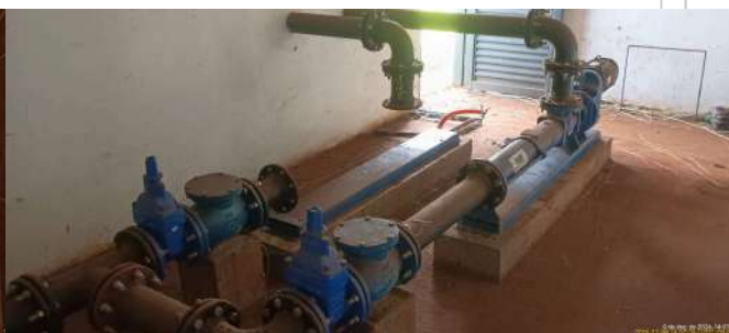
Foto 9 - Vista interna do conjunto motobomba instalado.
