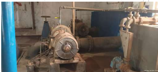
Foto 9 - Conjuntos motobomba do sistema de retrolavagem dos filtros.
