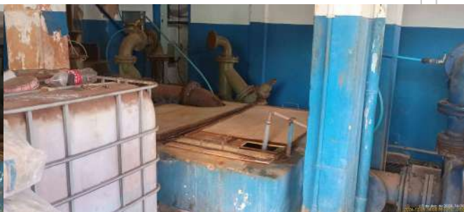
Foto 19 - EEAT no piso térreo da ETA.
