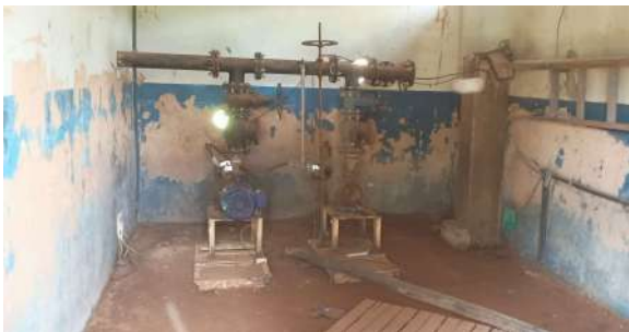
Foto 5 - Vista interna da casa de bombas.
