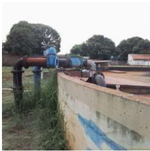
Foto 6 - Tubulações de recalque até o reservatório elevado de concreto.
