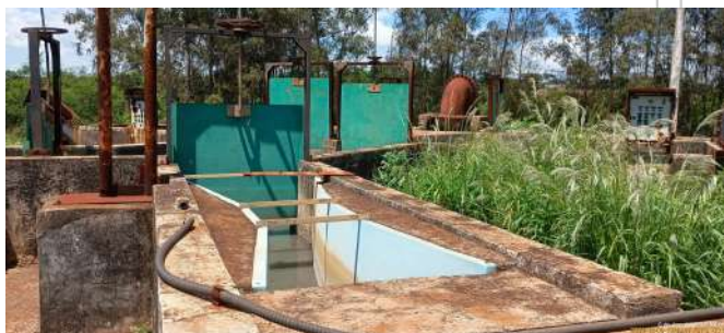
Foto 27 - Calha Parshall (sem gradação adequada) no canal de direcionamento do esgoto para a segunda estação elevatória de esgoto.
