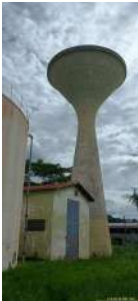
Foto 3 - EEAT e reservatório elevado Sorvetão.
