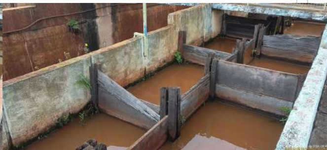
Foto 2 - Situação das chicanas de madeira dos floculadores.
