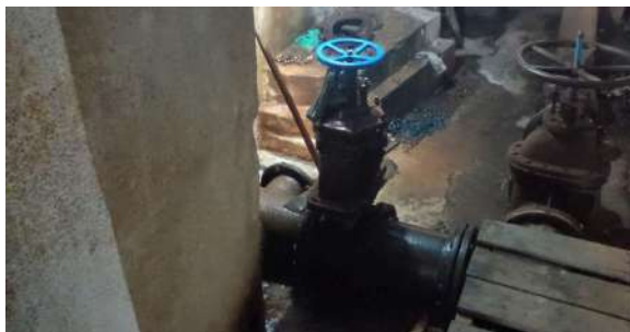
Foto 1 - Situação geral da área abaixo dos filtros.
