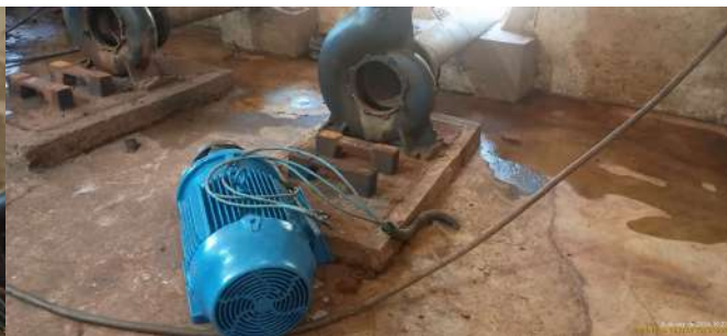
Foto 11 - Motor de um dos conjuntos motobomba não instalado.
