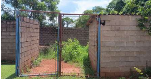
Foto 3 - Vista externa da EEE.
