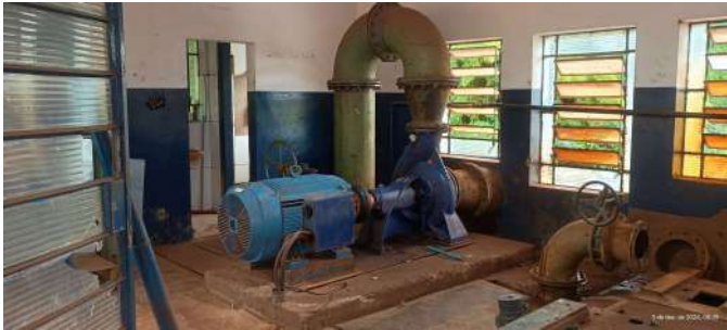
Foto 5 - Conjunto motobomba 01 instalado e local do quarto conjunto, ausente no momento da fiscalização.
