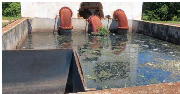
Foto 28 - Tanque de sucção da segunda estação elevatória.
