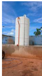
Foto 6 - Ausência de identificação padronizada do tanque de PAC.
