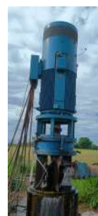
Foto 3 - Vista do poço (motor externo).
