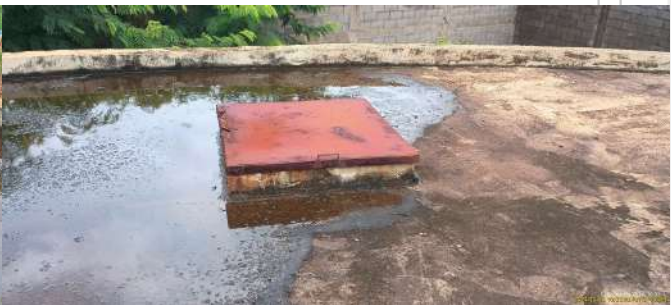
Foto 2 - Situação de uma das tampas de inspeção do reservatório.
