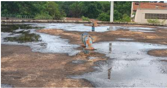
Foto 1 - Tubos de ventilação (respiro) sem tela de proteção.
