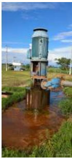
Foto 4 - Vista do poço (motor externo).
