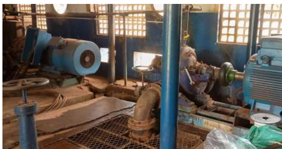
Foto 3 - Conjuntos motobomba da EEAT.
