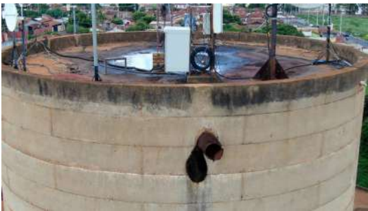
Foto 2 - Ausência de tela no tubo extravasor.
