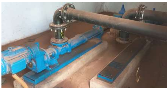
Foto 5 - Vista interna do conjunto motobomba instalado.
