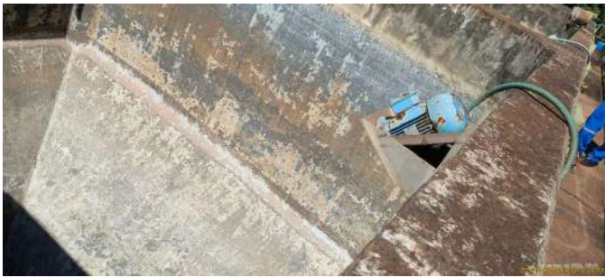
Foto 17 - Ausência de eixo girante e hélice em um dos tanques de adensamento.
