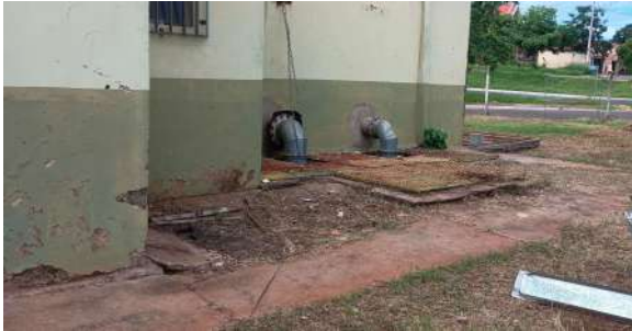
Foto 21 - Poço de sucção de água bruta.
