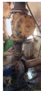
Foto 2 - Detalhe do local do vazamento.
