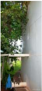
Foto 3 - Tubo extravasor e de limpeza do reservatório.
