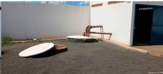
Foto 4 - Poços de chegada do esgoto e, ao lado da casa de bombas, poço de sucção.
