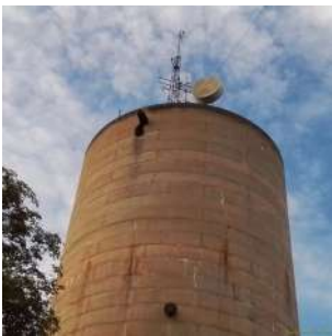
Foto 1 - Ausência de tela no tubo extravasor.
