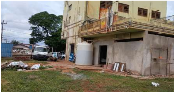
Foto 7 - Ausência de bacia de contenção para o tanque de hipoclorito de sódio.
