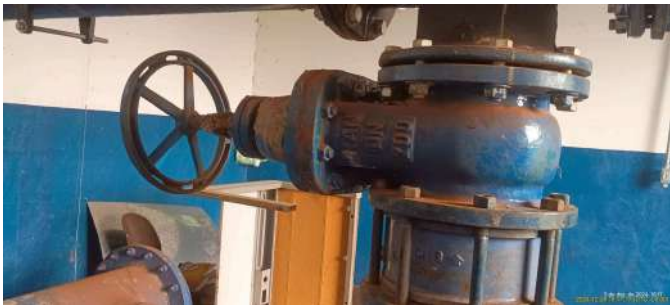
Foto 1 - Local do vazamento na tubulação de recalque.
