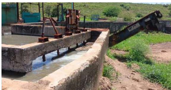
Foto 3 - Situação dos equipamentos do tanque da linha 1 de lagoas.
