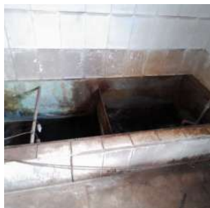
Foto 9 - Ponto de dosagem de produtos químicos, dentro da casa de química.
