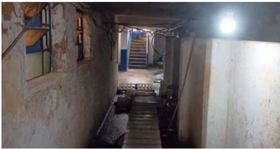
Foto 1 - Situação estrutural e de vazamentos abaixo dos filtros.
