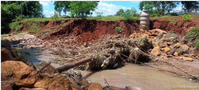
Foto 1 - Trecho do emissário, com material preso na tubulação.
