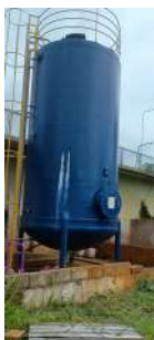
Foto 23 - Reservatório de hidróxido de cálcio, em sistema de comodata com o fabricante.
