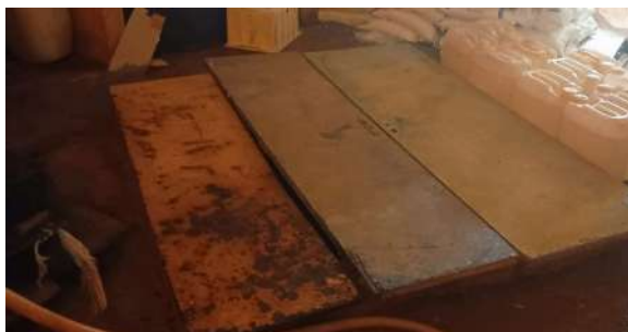
Foto 5 - Situação das tampas da canaleta de água tratada.
