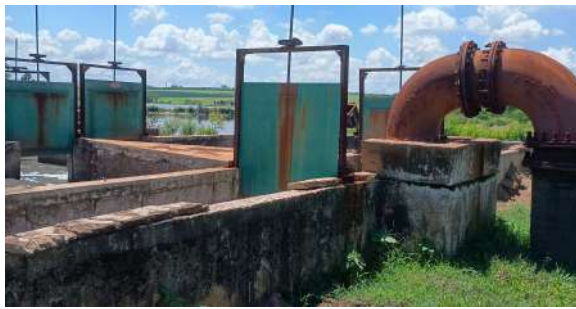
Foto 19 - Tanques de chegada do esgoto da estação elevatória inicial, com divisão de vazão para a linha 1 de lagoas e para a segunda estação elevatória.
