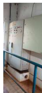
Foto 9 - Painel elétrico e de comando da elevatória..
