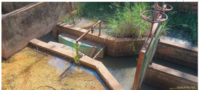
Foto 5 - Calha Parshall e medidor de vazão (não está funcionando) após caixa desarenadora.
