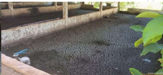
Foto 21 - Leitos de secagem do lodo adensado.
