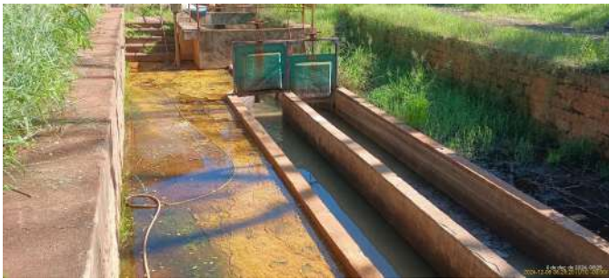
Foto 1 - Ausência de guarda-corpo no entorno do tratamento preliminar.
