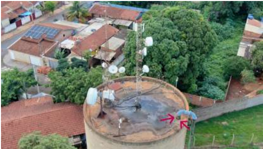
Foto 2 - Indicação do local sem vedação adequada.
