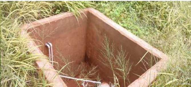
Foto 2 - Caixa sem proteção ou delimitação que impeça quedas.
