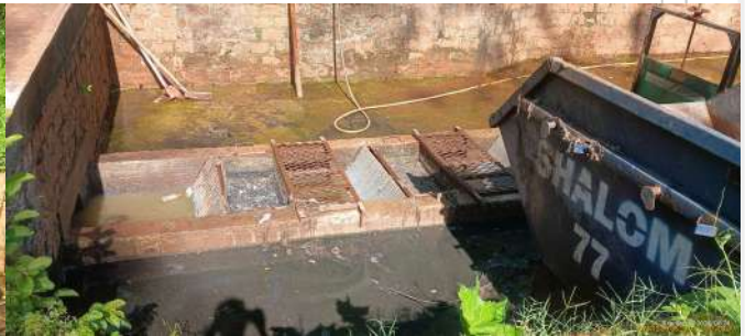
Foto 2 - Gradeamento do tratamento preliminar.
