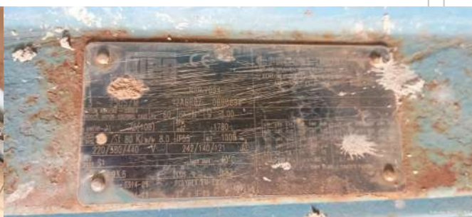
Foto 14 - Placa de especificações técnicas do motor do conjunto 1.
