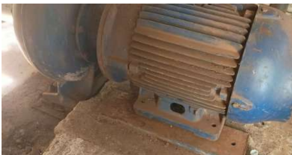
Foto 5 - Conjunto motobomba sem a devida fixação.
