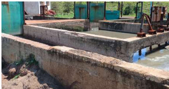
Foto 22 - Tanque de chegada do esgoto no começo da linha 1 de lagoas.
