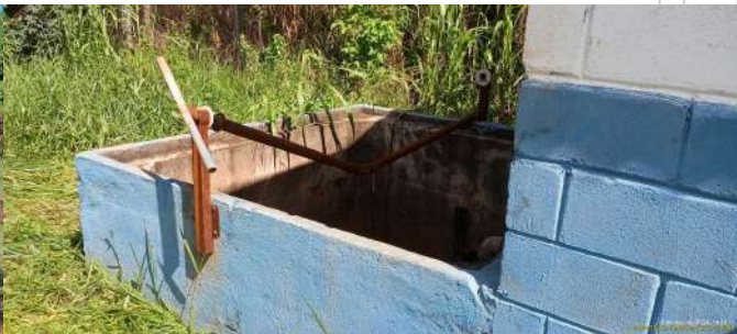
Foto 2 - Poço de chegada do esgoto, gradeamento e sucção.
