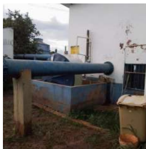
Foto 8 - Tanque de armazenamento de produto químico.
