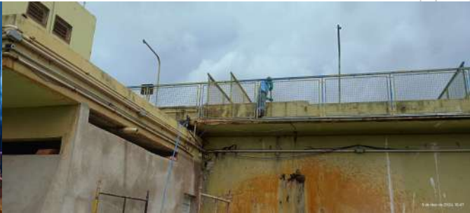
Foto 6 - Vazamentos nas laterais da ETA (flocladores).
