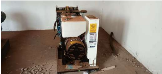
Foto 10 - Conjunto gerador a diesel ainda não instalado.
