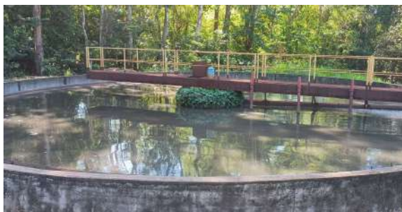
Foto 11 - Avarias no decantador 1.
