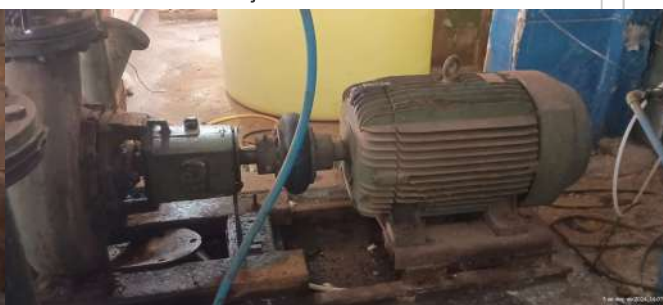
Foto 6 - Conjunto motobomba 2 da EEAT.
