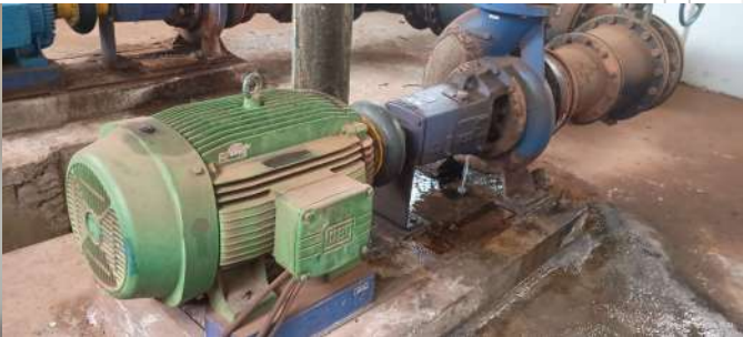
Foto 4 - Conjunto motobomba 1 da EEAT.
