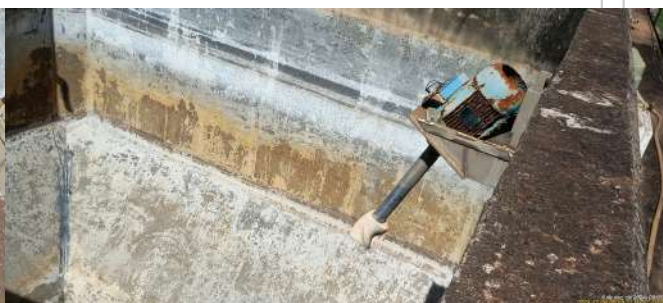
Foto 16 - Equipamento (turbina/misturador) dos tanques de adensamento de lodo danificados.
