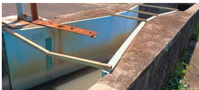
Foto 1 - Situação da Calha Parshall de entrada.
