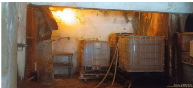
Foto 3 - Situação abaixo dos floculadores, com vazamentos e infiltrações.
