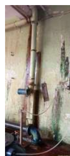
Foto 2 - Vazamentos na estrutura abaixo dos filtros.
