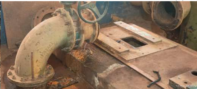
Foto 2 - Detalhe do vazamento.
