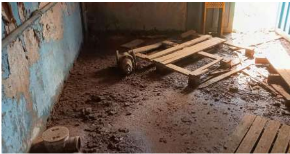
Foto 1 - Situação do piso no interior da EEE.
