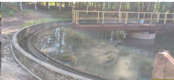
Foto 10 - Avarias no decantador 2.
