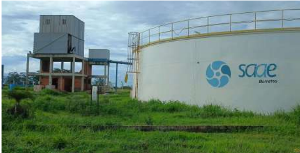
Foto 7 - Sistema de resfriamento e reservatório.
