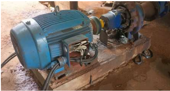
Foto 1 - Exposição de cabos elétricos do motor do conjunto motobomba próximo ao portão, sem tampa da caixa de ligação.
