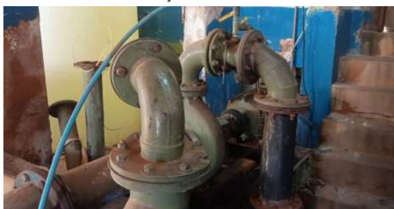
Foto 5 - Barrilete de adução de água tratada.
