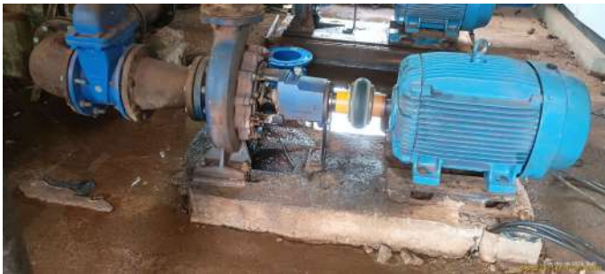
Foto 1 - Detalhe da drenagem inadequada da água de lubrificação de gaxeta do equipamento 1.
