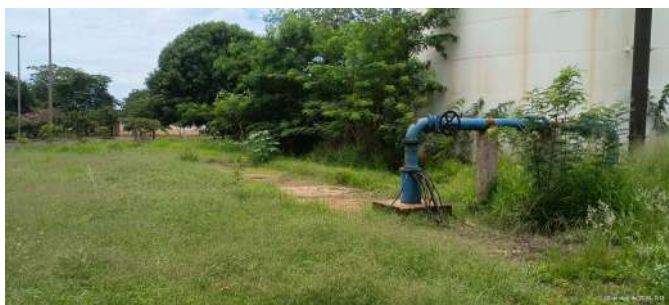
Foto 3 - Ausência de cerca.
