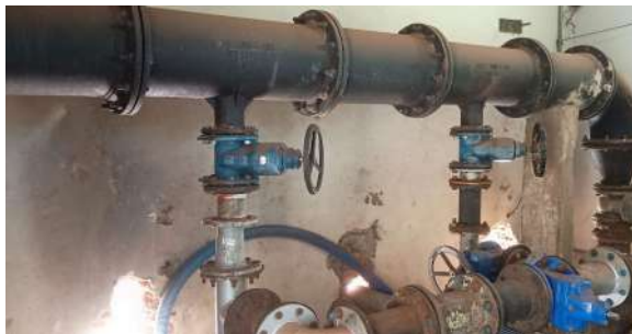
Foto 10 - Barrilete de recalque da EEE.
