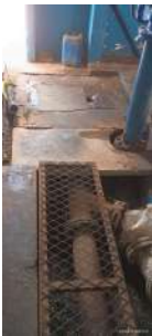
Foto 1 - Situação do piso da EEAT.
