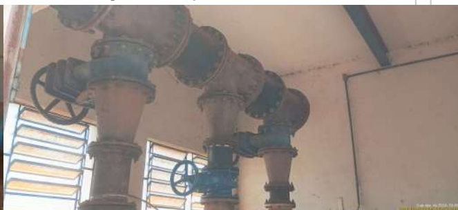
Foto 31 - Barrilete de recalque.
