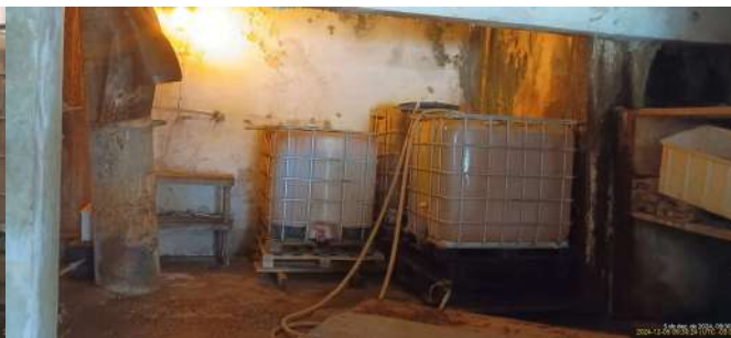
Foto 22 - Tanque e bombonas de armazenamento de produtos químicos.
