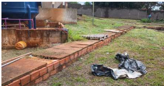
Foto 7 - Situação das tampas da canaleta de água tratada.
