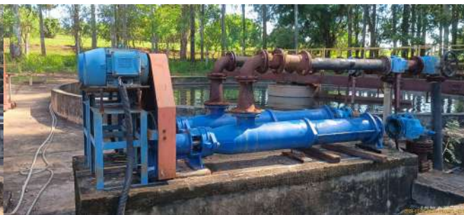
Foto 19 - Conjuntos motobomba de recirculação de lodo.
