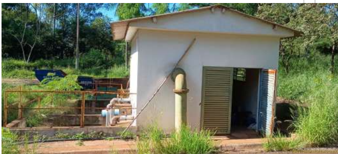
Foto 41 - Estação elevatória de esgoto, ao lado do tratamento preliminar.
