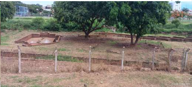
Foto 2 - Ausência de guarda-corpos ou limitadores de acesso nas estruturas de derivação da água bruta.
