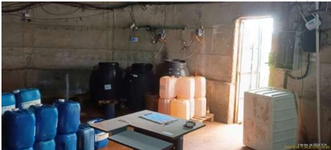
Foto 7 - Vista geral do armazenamento de produtos químicos.
