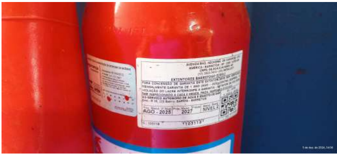
Foto 1 - Validade do extintor dentro do prazo regular.
