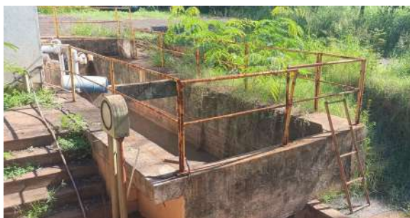
Foto 1 - Situação do guarda-corpo do tanque de sucção da elevatória de esgoto.
