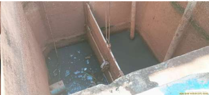
Foto 4 - Poço de chegada do esgoto, gradeamento e sucção.
