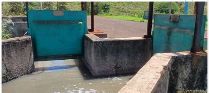
Foto 24 - Local da divisória com direcionamento para a segunda elevatória e para a linha 1 de lagoas.
