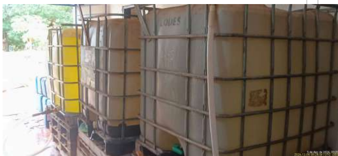
Foto 3 - Tanques de armazenamento de produtos químicos.
