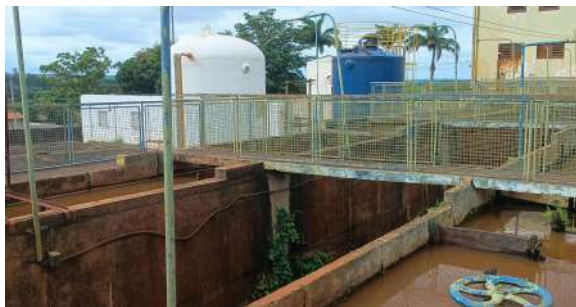
Foto 12 - Situação geral dos canais de floculação e, ao fundo, tanques de armazenamento de produtos químicos.
