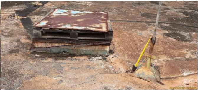
Foto 2 - Situação de outra tampa de inspeção do reservatório.
