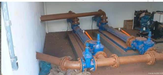
Foto 6 - Conjuntos motobomba da EEE.
