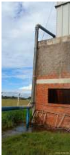
Foto 2 - Tubulação com vazamentos.
