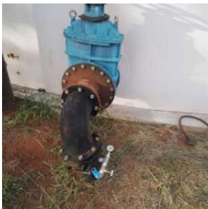
Foto 4 - Manômetro na tubulação de saída do reservatório.
