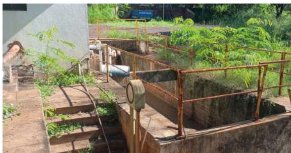
Foto 6 - Tanque de sucção da elevatória de esgoto.
