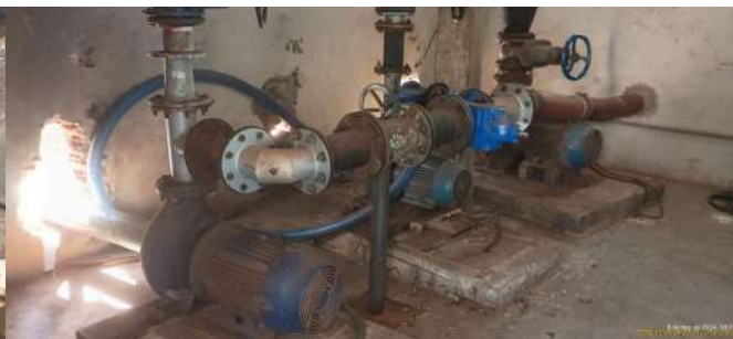
Foto 9 - Vista interna da elevatória e dos conjuntos motobomba instalados.
