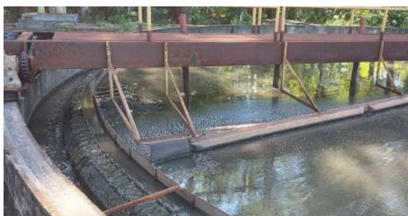
Foto 13 - Avarias no decantador 1.
