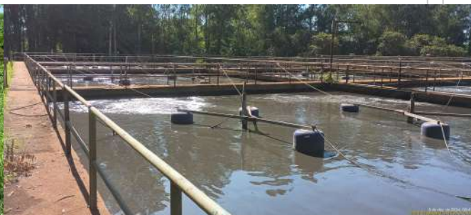
Foto 13 - Tanques de aeração.
