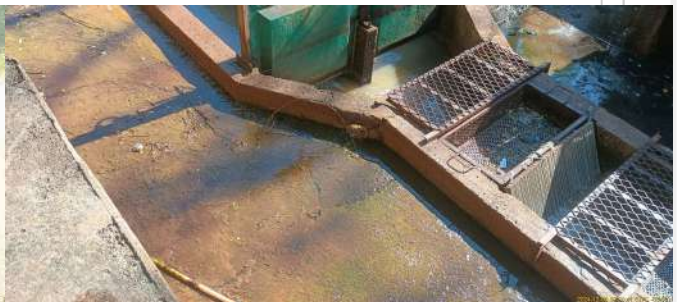
Foto 4 - Afloramento de água do subsolo no entorno do tratamento preliminar.
