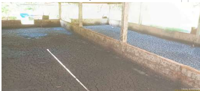
Foto 22 - Leitos de secagem do lodo adensado.
