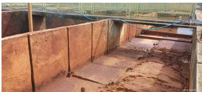
Foto 8 - Situação geral da estruturação de floculação.
