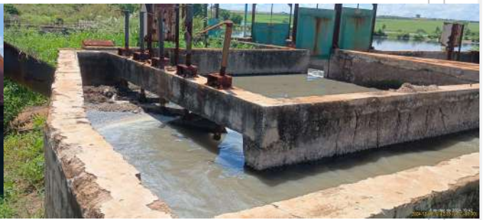
Foto 20 - Tanque de chegada do esgoto no começo da linha 1 de lagoas.
