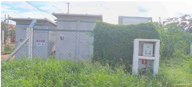
Foto 1 - Situação das cabines de energia e do abrigo do painel de comando.
