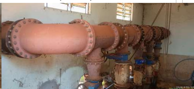
Foto 8 - Barrilete de recalque.
