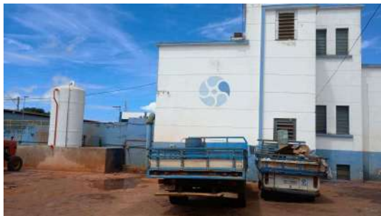
Foto 5 - Tanque de armazenamento de PAC.
