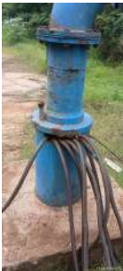
Foto 1 - Tubo de medição de nível.
