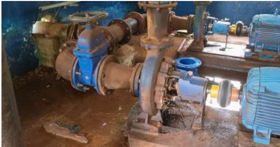
Foto 1 - Piso molhado devido à água de lubrificação de gaxetas e ao vazamento.
