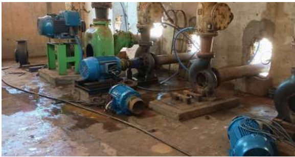
Foto 1 - Situação dos conjuntos motobomba da estação elevatória inicial
