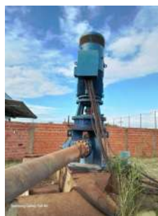
Foto 4 - Vista do motor externo do poço.
