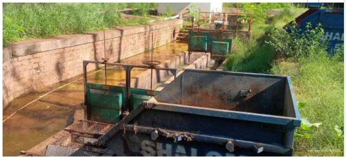
Foto 3 - Tratamento preliminar: gradeamento e caixa desarenadora.
