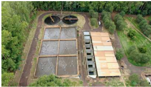
Foto 37 - Vista aérea dos tanques de aeração, decantadores, tanques de adensamento de lodo e dos leitos de secagem (cobertos com telhado).
