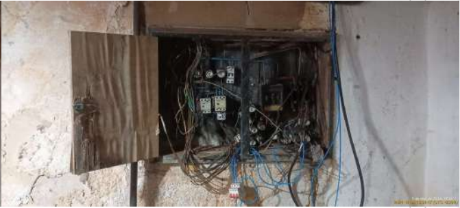
Foto 6 - Painel elétrico do elevador de carvão ativado e da parte inferior da ETA Baroni.
