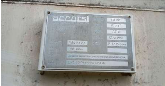
Foto 7 - Placa de especificações técnicas do reservatório.
