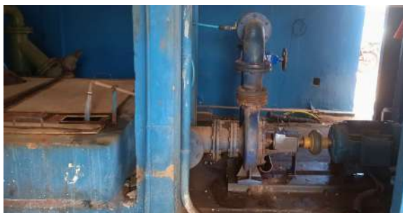
Foto 1 - Primeiro conjunto motobomba da EEAT.
