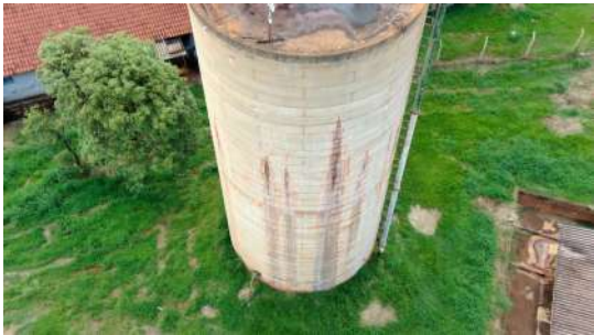
Foto 1 - Lateral do reservatório com sinais de vazamentos.
