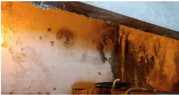
Foto 3 - Vazamentos na estrutura da ETA, abaixo do canal de chegada de água bruta e floxulação.
