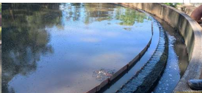
Foto 14 - Avarias no decantador 2.
