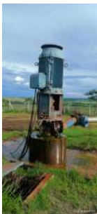
Foto 2 - Vista do poço (motor externo).
