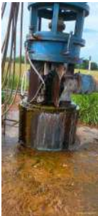
Foto 1 - Vazamentos no eixo da bomba.
