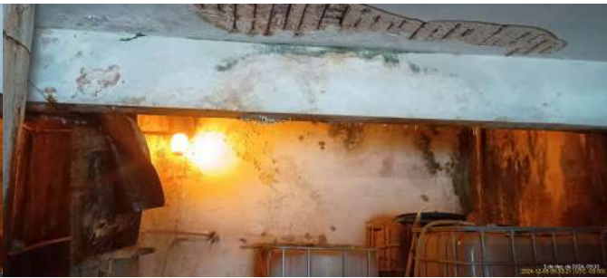
Foto 4 - Vazamentos na estrutura da ETA, abaixo do canal de chegada de água bruta e floxulação.
