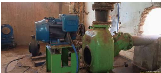
Foto 14 - Outro conjunto motobomba que não está em operação.
