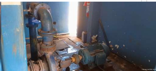
Foto 2 - Primeiro conjunto motobomba da EEAT.
