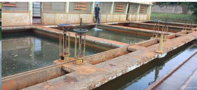
Foto 16 - Filtros da ETA.
