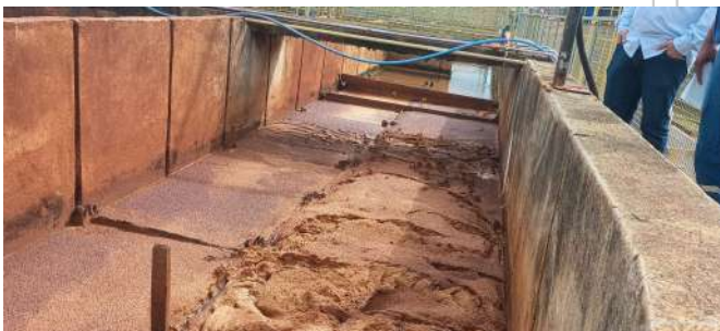
Foto 7 - Situação geral da estruturação de floculação.
