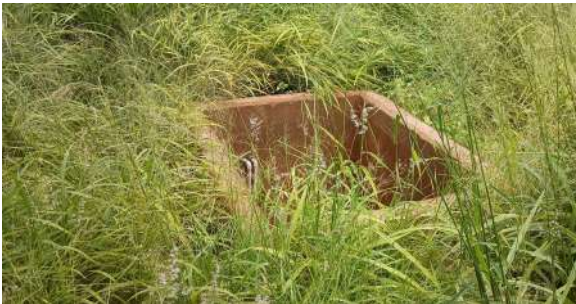
Foto 1 - Caixa sem proteção ou delimitação que impeça quedas.
