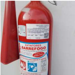
Foto 1 - Prazo de vencimento do extintor de incêndio.
