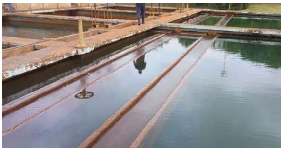
Foto 15 - Decantadores e parte dos filtros.
