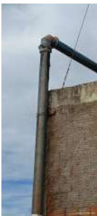
Foto 3 - Tubulação com vazamentos.
