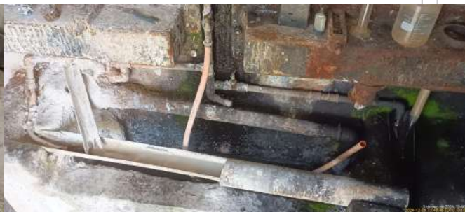
Foto 15 - Canaletas para dosagem da cal e carvão.
