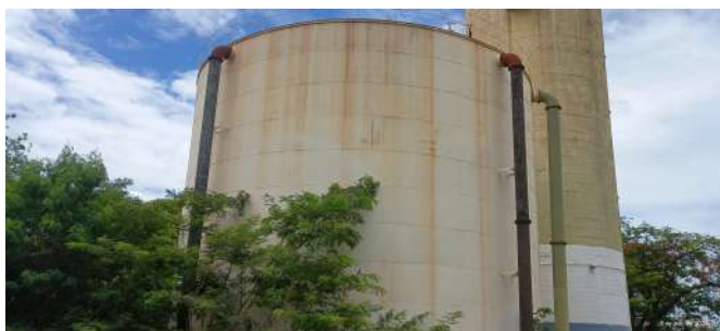
Foto 4 - reservatório apoiado e, ao fundo, o elevado.
