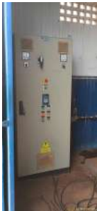
Foto 4 - Painel elétrico e de comando no interior da EEAT.
