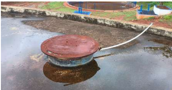
Foto 1 - Situação de uma das tampas de inspeção do reservatório.
