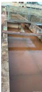
Foto 10 - Situação geral da estruturação de floculação.
