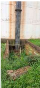
Foto 3 - Tubulação de chegada de água.
