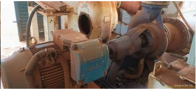
Foto 2 - Único conjunto motobomba instalado e em operação na segunda estação elevatória.
