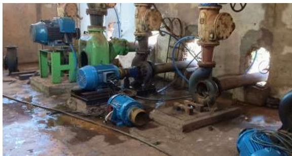
Foto 10 - Conjuntos motobomba da elevatória.
