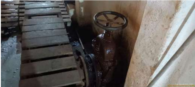
Foto 5 - Vazamentos no registro e piso molhado.
