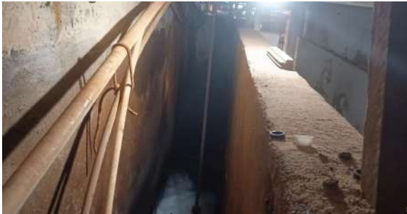
Foto 3 - Situação estrutural e de vazamentos abaixo dos filtros.
