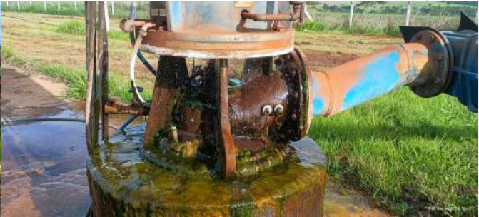
Foto 2 - Local do vazamento.
