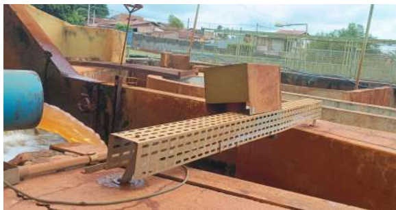
Foto 3 - Macromedidor na chegada da água bruta.
