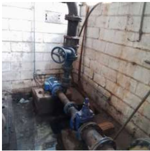
Foto 8 - Conjunto motobomba booster.
