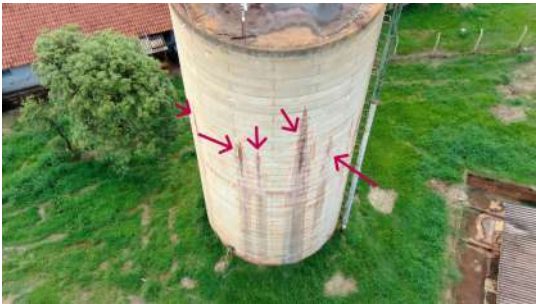
Foto 2 - Indicação dos pontos com vazamentos.
