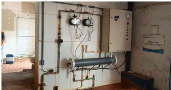
Foto 19 - Sistema de geração de hipoclorito de sódio in loco.
