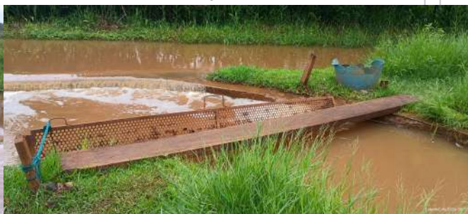
Foto 17 - Gradeamento da água bruta.
