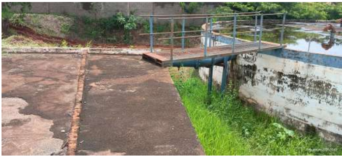
Foto 1 - Ausência de guarda-corpo na laje do reservatório, próximo à passarela.
