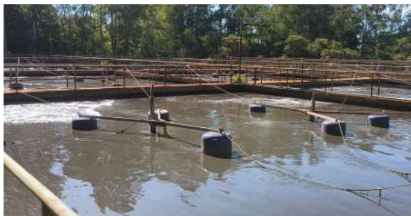
Foto 14 - Tanques de aeração.
