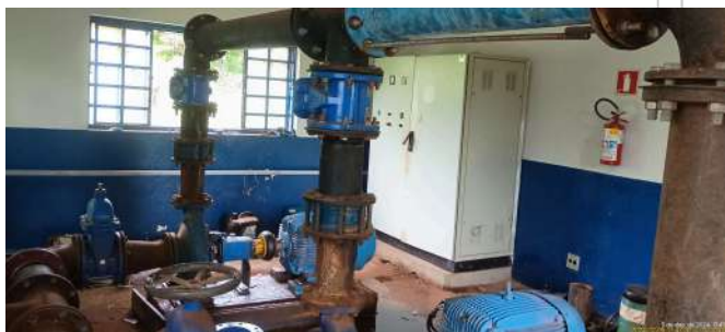
Foto 4 - Barrilete de recalque da EEAT e, ao fundo, painel elétrico e de comando.
