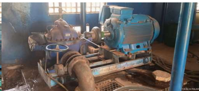
Foto 4 - Conjunto motobomba 1 (direita).
