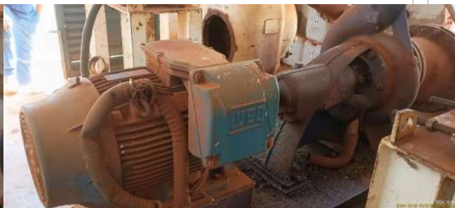
Foto 33 - Conjunto motobomba em operação da estação.
