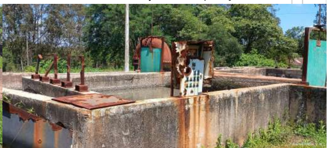
Foto 4 - Situação dos equipamentos do tanque da linha 1 de lagoas.
