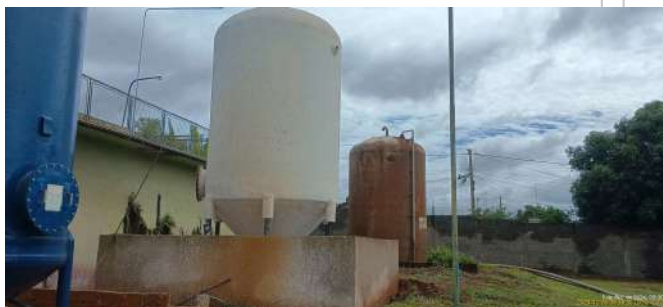
Foto 24 - Reservatório de sulfato férrico e, ao fundo, e reservatório que futuramente será removido.
