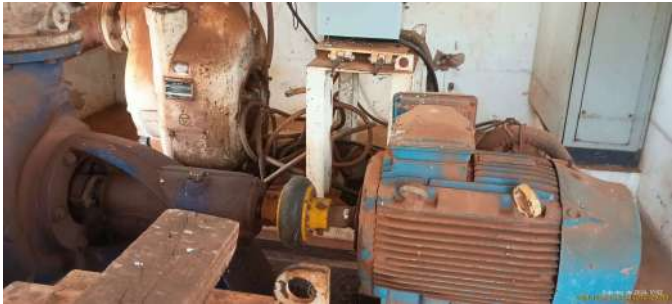
Foto 3 - Único conjunto motobomba instalado e em operação na segunda estação elevatória.
