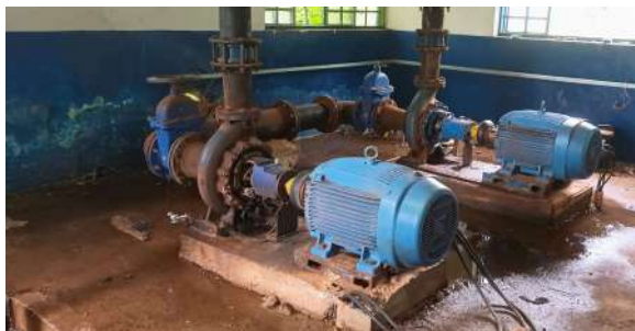
Foto 5 - Conjuntos motobomba da EEAT.
