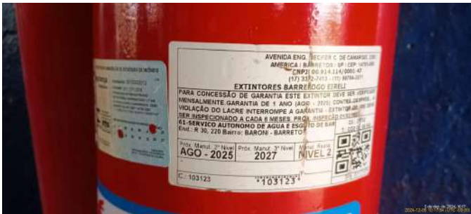
Foto 1 - Prazo de vencimento do extintor de incêndio da EEAT.
