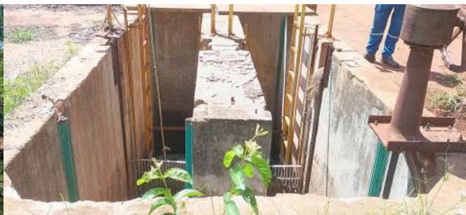
Foto 2 - Chegada do esgoto bruto e canais de gradeamento.
