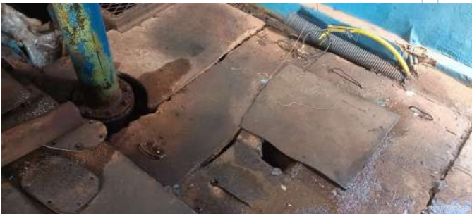
Foto 2 - Situação da placa de concreto da tampa do reservatório.
