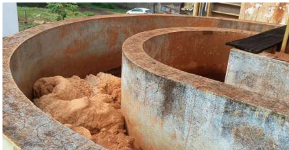
Foto 5 - Canais de direcionamento da água bruta para demais etapas do tratamento.
