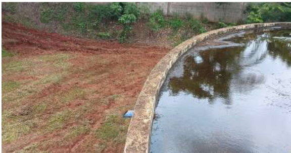
Foto 1 - Ausência de guarda-corpo na laje do reservatório.
