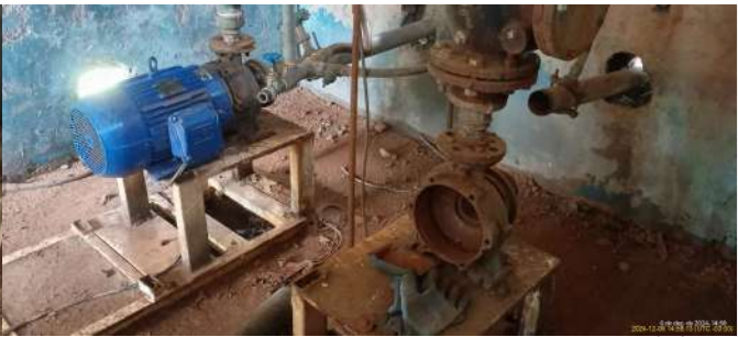
Foto 8 - Único conjunto motobomba instalado no local.
