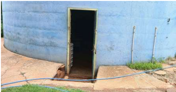
Foto 5 - Base do reservatório elevado onde ficam as bombas dosadoras de produtos químicos e as bombonas.
