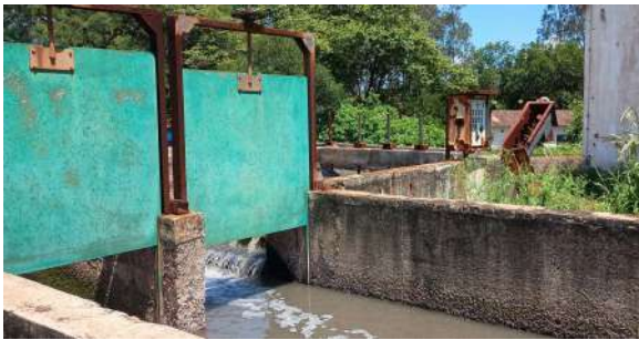
Foto 5 - Situação dos equipamentos do tanque da linha 1 de lagoas.
