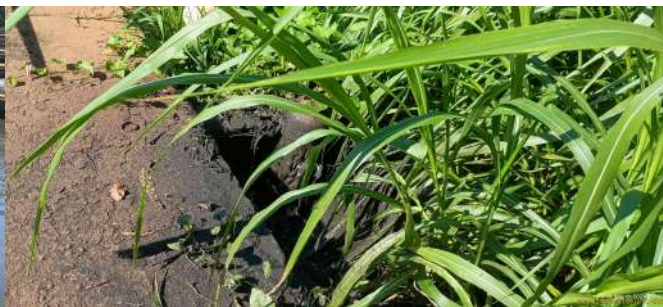
Foto 8 - Ausência de limpeza no ponto de chegada da tabulação de esgoto da elevatória.
