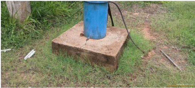
Foto 1 - Laje de proteção do poço, em dimensões inferiores ao mínimo previsto em normas técnicas.
