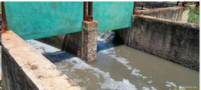
Foto 23 - Tanque de chegada do esgoto no começo da linha 1 de lagoas.
