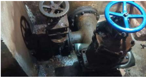
Foto 3 - Vazamentos nas tubulações e registros.
