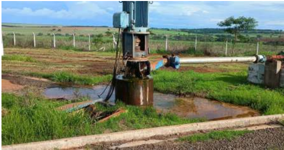
Foto 1 - Situação do terreno em função dos vazamentos.
