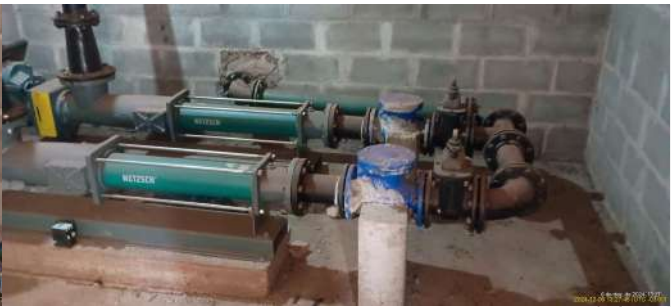
Foto 6 - Conjuntos motobomba da EEE.
