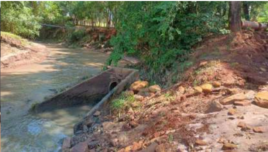
Foto 2 - Ponto de lançamento de esgoto antes da abertura de registros do bypass.
