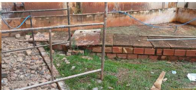
Foto 6 - Situação das tampas da canaleta de água tratada.
