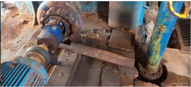
Foto 2 - Escoamento inadequado da água de lubrificação de gaxeta do conjunto 1.
