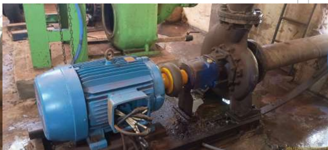
Foto 13 - Único conjunto motobomba em operação. Destaque para a ausência da tampa da caixa de ligação elétrica.
