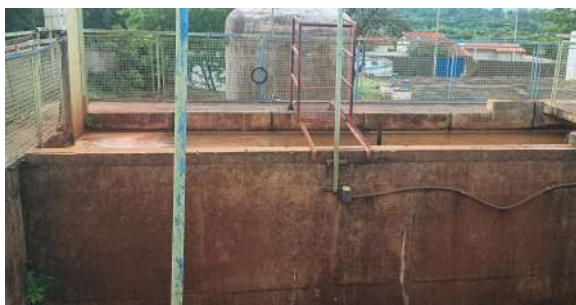
Foto 1 - Ausência de guarda-corpo na estrutura de floculação da ETA.
