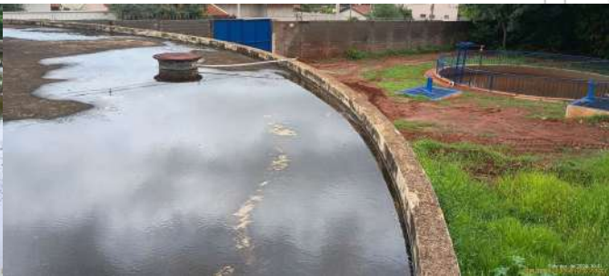
Foto 2 - Ausência de guarda-corpo na laje do reservatório.
