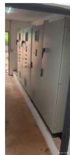
Foto 12 - Painéis elétricos e de comando da captação.
