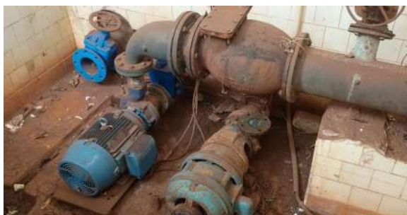
Foto 3 - Conjunto motobomba da EEAT.
