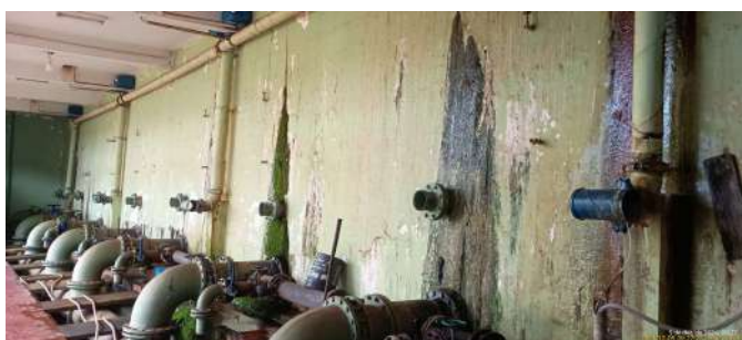
Foto 1 - Vazamentos na estrutura abaixo dos filtros.
