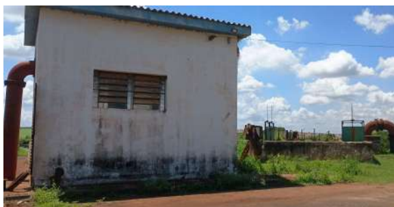
Foto 17 - Segunda estação elevatória, situada no começo da linha 1 de lagoas. Esta estação recebe
