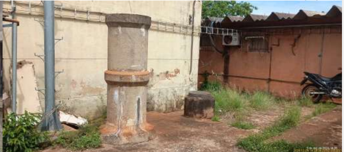
Foto 6 - O tubo vertical da esquerda é o extravasor. Já o da direita (menor) é utilizado para limpeza, conectado à rede de águas pluviais.
