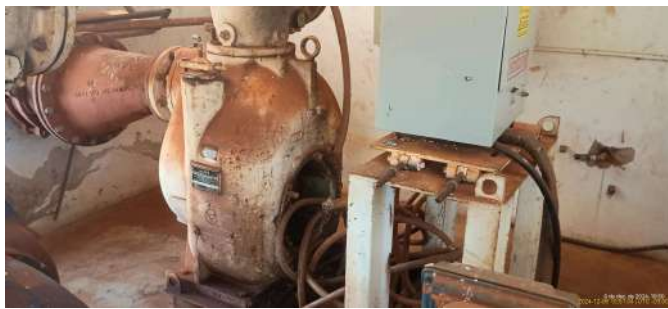
Foto 34 - Segundo equipamento (bomba) inutilizado na estação.
