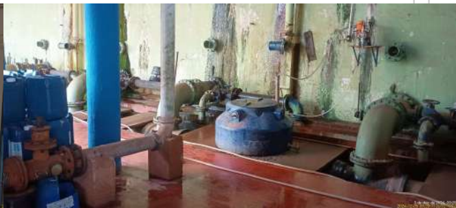
Foto 20 - Vista geral da parte abaixo dos filtros. Tanque de dosagem de produto químico após filtração.
