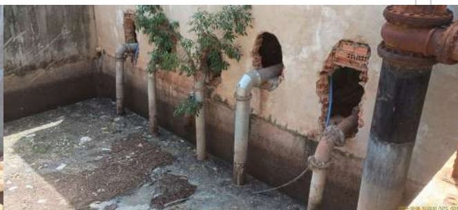
Foto 6 - Poço de sucção da elevatória.
