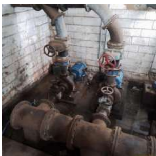
Foto 5 - Conjuntos motobomba de recalque para o reservatório elevado.
