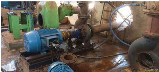
Foto 1 - Vazamento na tubulação do conjunto motobomba em operação.
