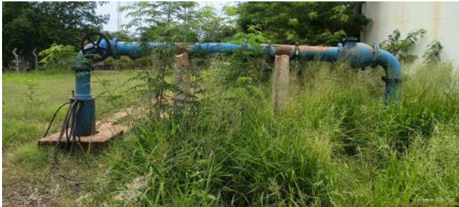
Foto 1 - Tomada de água bruta no cavalete do poço.
