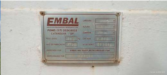
Foto 2 - Placa de especificações técnicas do reservatório.
