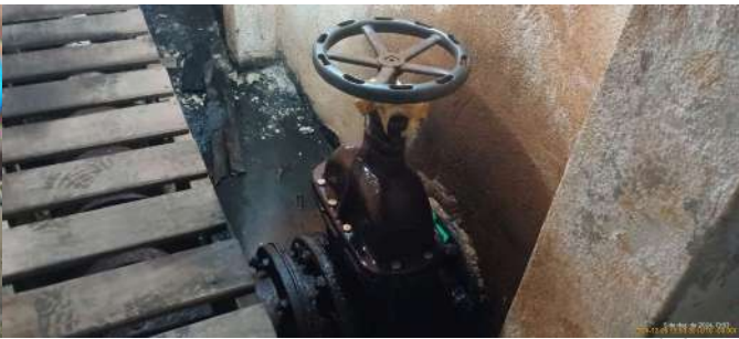
Foto 4 - Vazamentos no registro e piso molhado.
