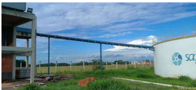
Foto 9 - Tubulação para abastecimento do reservatório após, resfriamento e dosagem de produtos químicos.
