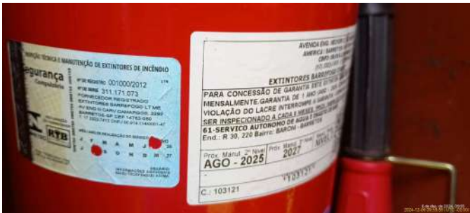
Foto 1 - Extintor de incêndio no prazo adequado.
