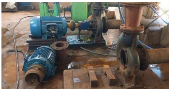
Foto 12 - Motor de outro conjunto motobomba não instalado. No centro o único conjunto em operação e, ao fundo (cor verde), outro conjunto que não está em operação.
