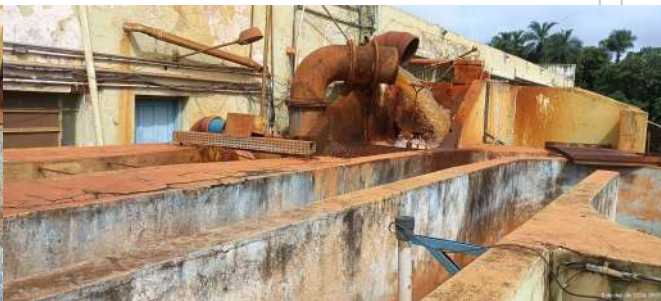
Foto 6 - Detalhe da chegada da água bruta.
