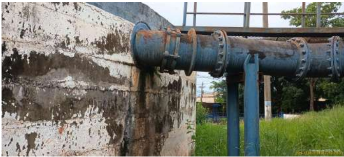
Foto 1 - Vazamento na lateral do reservatório, próximo à tubulação.
