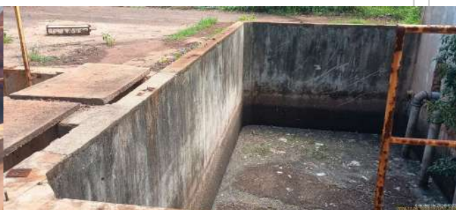
Foto 2 - Ausência de guarda-corpo.
