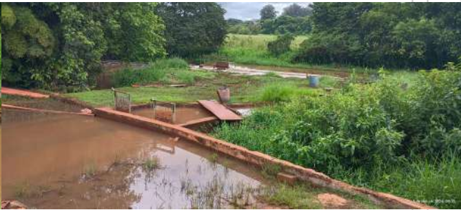
Foto 4 - Vista geral da Captação, sem guarda-corpos.
