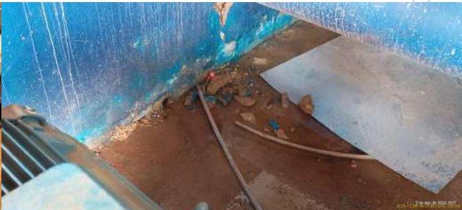
Foto 2 - Excesso de água no piso, devido à incorreta drenagem.
