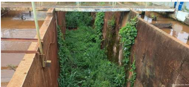
Foto 11 - Vista da área entre os dois canais de floculação.
