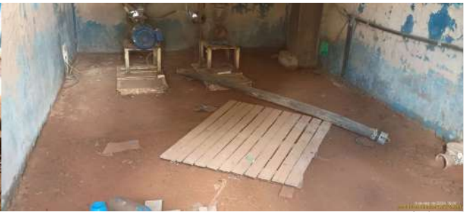
Foto 2 - Situação do piso no interior da EEE.
