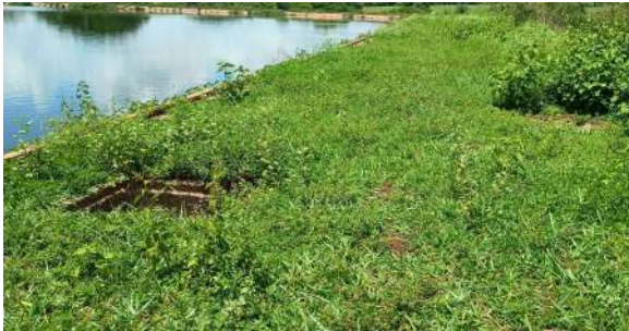
Foto 7 - Outra caixa de passagem entre lagoas, sem qualquer proteção para evitar quedas.
