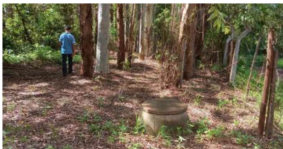
Foto 23 - PV do emissário de esgoto tratado.
