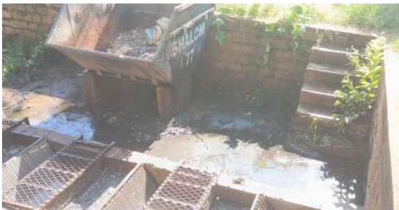
Foto 3 - Extravasamento de esgoto por falta de limpeza no turno da noite, sem operador.
