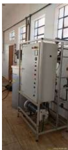
Foto 12 - Sistema de geração de hipoclorito de sódio.
