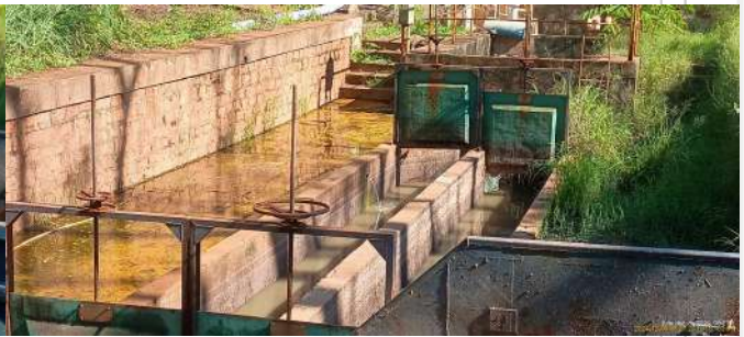
Foto 2 - Afloramento de água do subsolo no entorno do tratamento preliminar.
