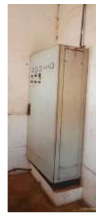
Foto 35 - Painel elétrico e de comando da elevatória.
