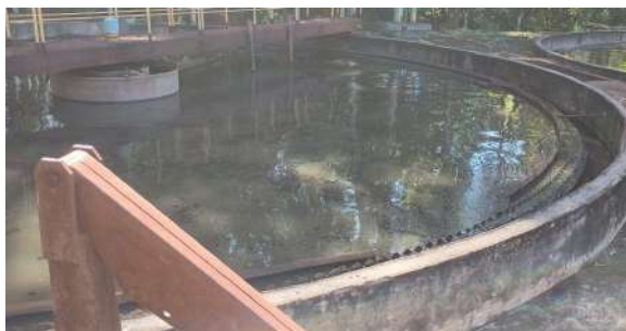
Foto 9 - Avarias no decantador 2.
