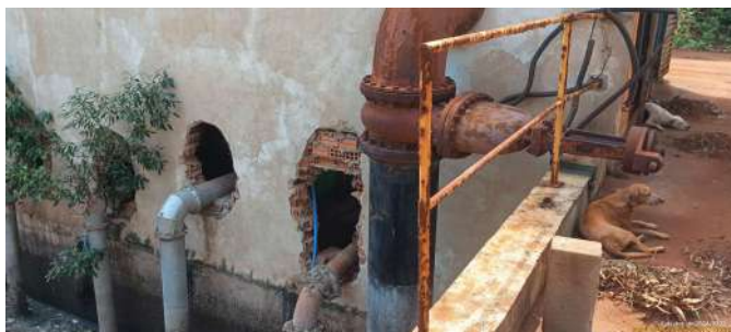
Foto 1 - Guarda-corpo existente no tanque de sucção em mau estado de conservação, com risco alto de quedas e acidentes.
