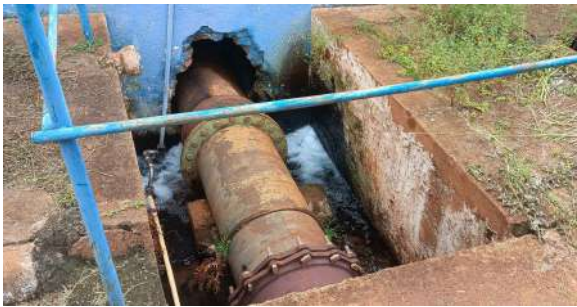
Foto 1 - Tubulação com vazamentos.
