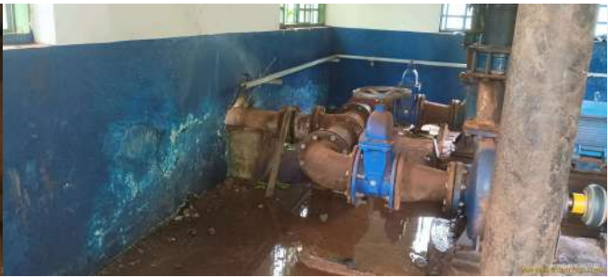
Foto 2 - Abertura excessiva na parede da EEAT.
