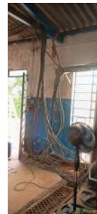
Foto 2 - Cabos e fios elétricos dispostos pela EEAT.
