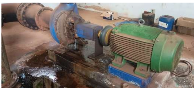
Foto 1 - Excesso de água na lubrificação da gaxeta do conjunto 1.
