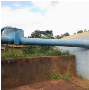
Foto 1 - Separação da tubulação entre os dois reservatórios semienterrados.
