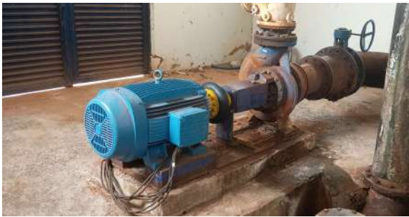
Foto 7 - Conjunto motobomba 2 da EEAT.
