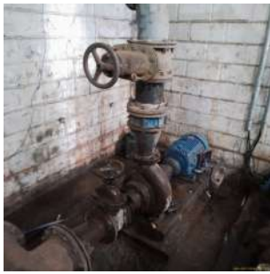
Foto 1 - Piso molhado devido aos vazamentos.
