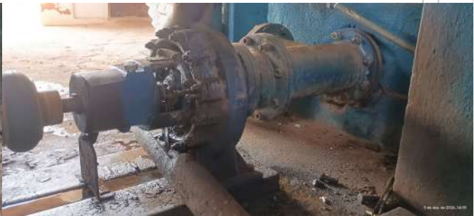
Foto 2 - Água de lubrificação de gaxeta do conjunto 1 em excesso.
