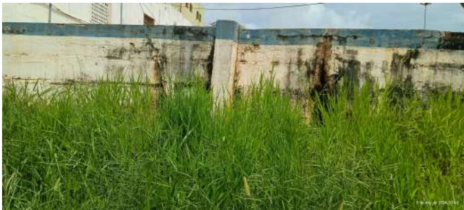
Foto 1 - Vazamentos na lateral do reservatório.
