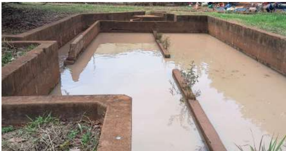
Foto 1 - Ausência de guarda-corpos ou limitadores de acesso nas estruturas de derivação da água bruta.
