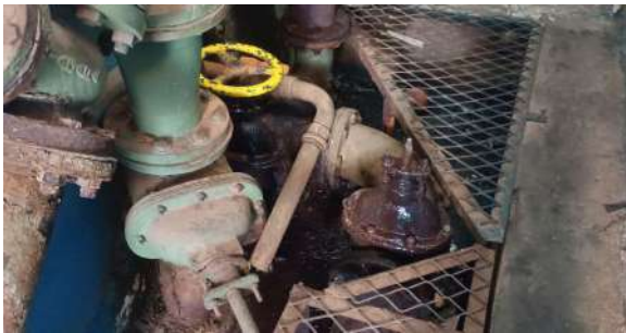
Foto 1 - Vazamento nos registro da tubulação de recalque do conjunto 2.
