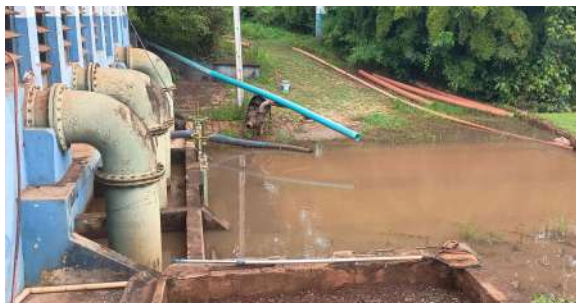
Foto 14 - Poço de sucção da captação Pitangueiras.
