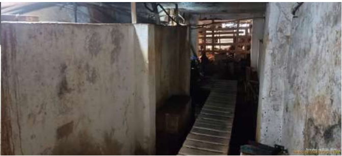
Foto 2 - Situação estrutural e de vazamentos abaixo dos filtros.
