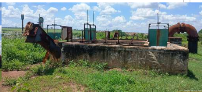
Foto 18 - Tanques de chegada do esgoto da estação elevatória inicial, com divisão de vazão
