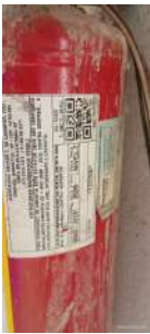
Foto 1 - Extintor de incêndio com prazo de validade adequado.
