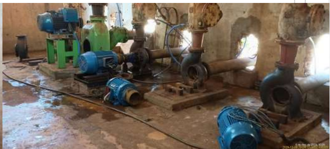
Foto 2 - Ausência de tampa da caixa de ligação elétrica do motor do conjunto em operação.
