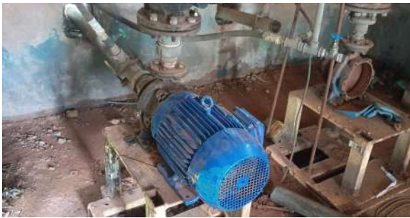
Foto 7 - Único conjunto motobomba instalado no local.
