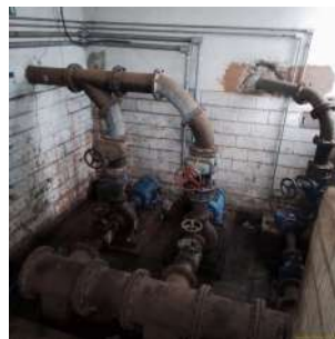
Foto 4 - Conjuntos motobomba (1+1R) de recalque para o reservatório elevado (esquerda) e booster (direita).
