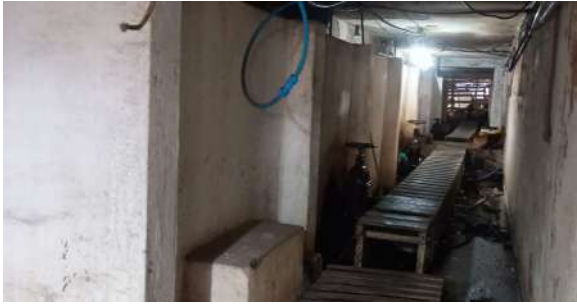
Foto 5 - Situação estrutural e de vazamentos abaixo dos filtros e cabos elétricos expostos.
