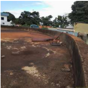
Foto 1 - Tampa de inspeção danificada.
