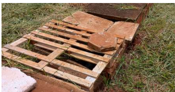
Foto 9 - Situação das tampas da canaleta de água tratada.
