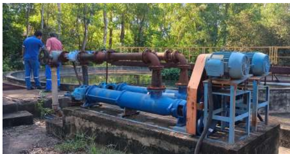
Foto 18 - Conjuntos motobomba de recirculação de lodo.
