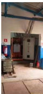
Foto 3 - Cabos e fios elétricos dispostos pela EEAT.
