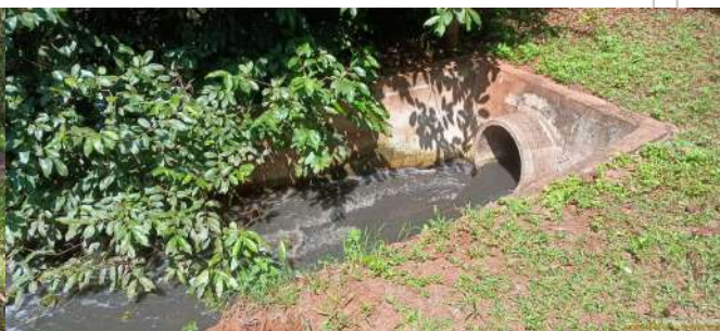
Foto 24 - Ponto de lançamento de esgoto tratado. Atentar para cor do efluente lançado no curso d'água.
