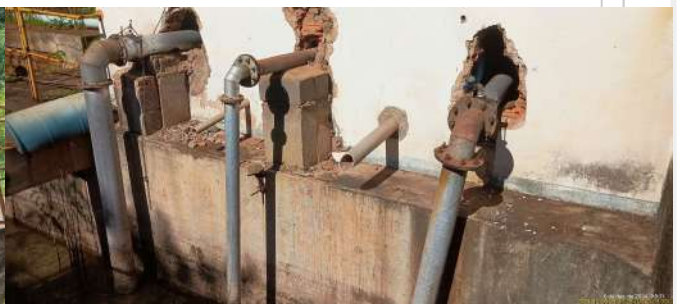
Foto 7 - Tubulações de sucção da elevatória.
