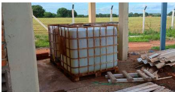
Foto 4 - Tanque de armazenamento de hipoclorito.
