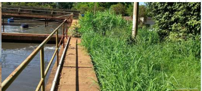
Foto 6 - Ausência de limpeza no ponto de chegada da tubulação de esgoto da elevatória.
