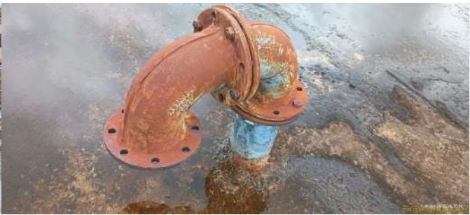
Foto 2 - Tubo de ventilação (respiro) sem tela de proteção.
