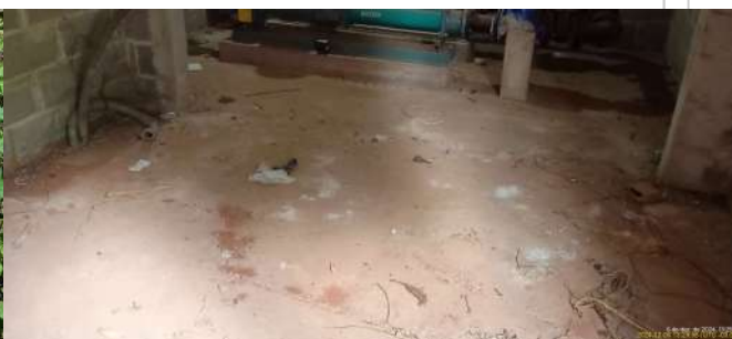
Foto 2 - Fissuras e rachaduras no piso do interior da casa de bombas.
