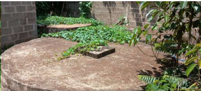
Foto 4 - Tanques de chegada do esgoto bruto e de acúmulo.
