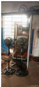
Foto 1 - Pannel elétrico e de comando da EEAT aberto com ventiladores para resfriamento,
