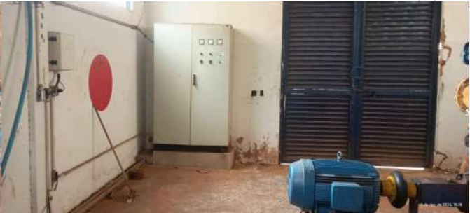
Foto 10 - Vista geral da EEAT e do painel elétrico e de comando.
