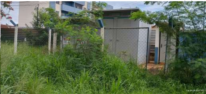
Foto 7 - Ausência de fechamento e isolamento da área dos painéis elétricos.
