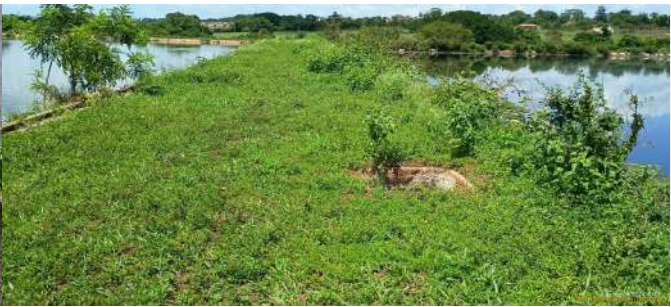
Foto 6 - Uma das caixas de passagem entre lagoas da linha 1.
