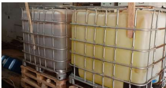
Foto 1 - Tanques de armazenamento de hipoclorito.
