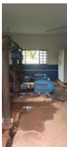
Foto 3 - Conjuntos motobomba da EEAT.
