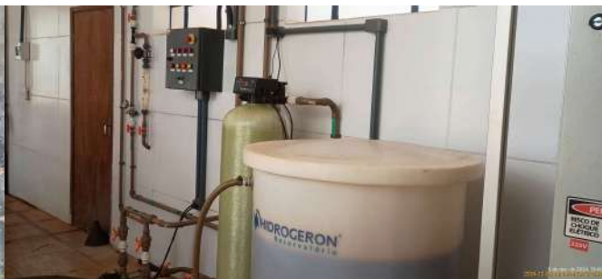
Foto 11 - Sistema de geração de hipoclorito de sódio.
