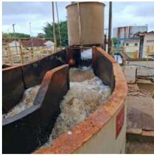
Foto 1 - Entrada de água bruta na ETA Fonte em Araraquara
