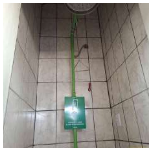
Foto 1 - Chuveiro de emergência na ETA Fonte em Araraquara
