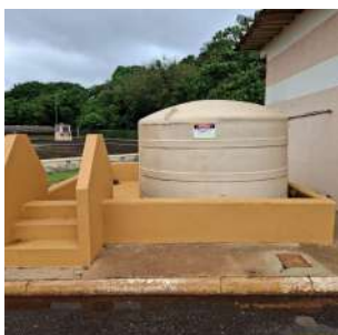
Foto 1 - Tanque de produto químico na ETA Fonte em Araraquara
