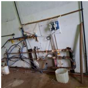
Foto 1 - Dosagem de produtos químicos na ETA Fonte em Araraquara
