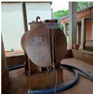
Foto 5 - Tanques de produtos químicos da ETA Paio em Araraquara
