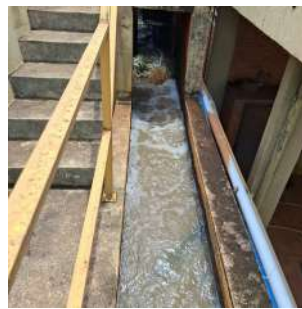
Foto 22 - Entrada de água bruta da ETA Paiol em Araraquara
