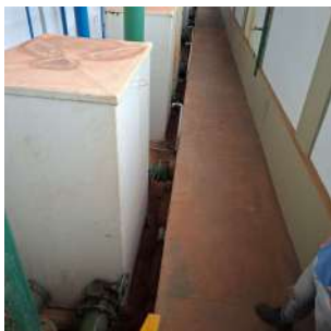
Foto 1 - Ausência de guarda-corpos da ETA Paiol em Araraquara
