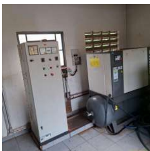
Foto 7 - Sala de centrifugas da ETE Bueno de Andrade em Araraquara
