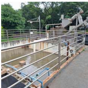
Foto 3 - Reator de batelada da ETE Bueno de Andrade em Araraquara
