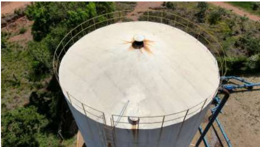
Foto 3 - Tampa de inspeção e tubulação de ventilação do Reservatório Flora em Araraquara
