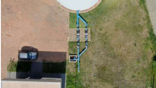
Foto 1 - Vista por drone dos boosters do São Rafael em Araraquara
