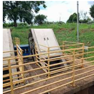
Foto 12 - Peneiras desativadas da ETE Araraquara
