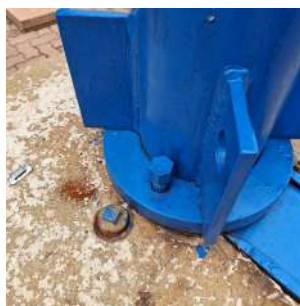
Foto 7 - Base do Poço São Rafael em Araraquara
