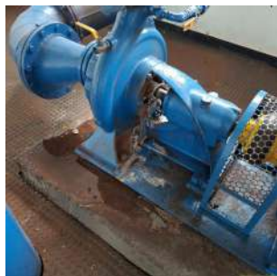
Foto 1 - Drenagem inadequada na Bomba da Estação elevatória de água tratada do Santa Lucia II em Araraquara
