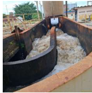
Foto 2 - Entrada de água bruta na ETA Fonte em Araraquara
