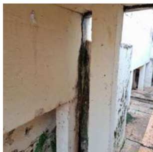
Foto 1 - Vazamento na estrutura do filtro na ETA Fonte em Araraquara
