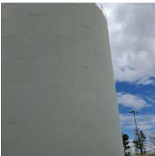
Foto 1 - Reservatório São Rafael em Araraquara
