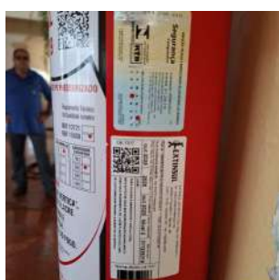
Foto 1 - Extintor de incêndio na ETA Fonte em Araraquara
