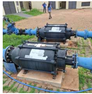
Foto 11 - Booster do Poço São Rafael em Araraquara
