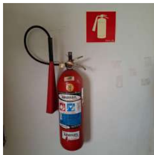
Foto 1 - Extintor de incêndio da ETA Paiol em Araraquara
