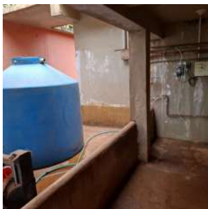
Foto 7 - Tanques de produtos químicos da ETA Paio em Araraquara
