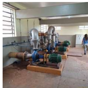
Foto 14 - Sala de bombas na ETA Fonte em Araraquara
