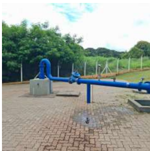
Foto 2 - Poço Santa Lucia em Araraquara
