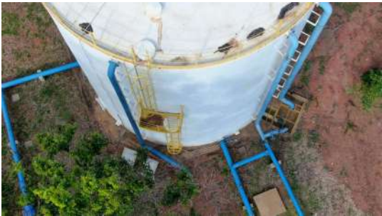
Foto 3 - Guarda-corpo do Reservatório R46 em Araraquara
