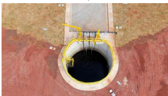
Foto 27 - Vista por drone da ETA Paiol em Araraquara
