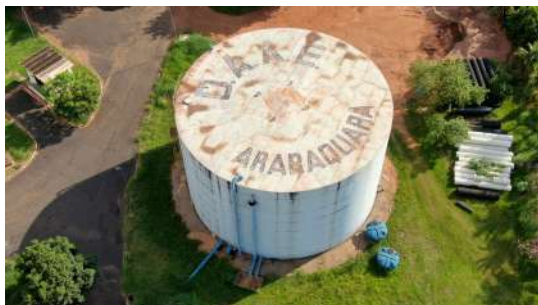
Foto 1 - Tubulações de entrada, saída e extravasamento no Reservatório R23 em Araraquara
