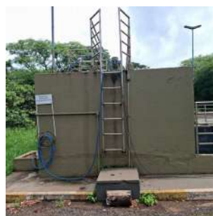
Foto 12 - Reator de batelada da ETE Bueno de Andrade em Araraquara
