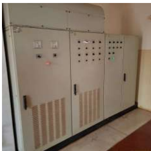
Foto 5 - Painéis elétricos na ETA Fonte em Araraquara
