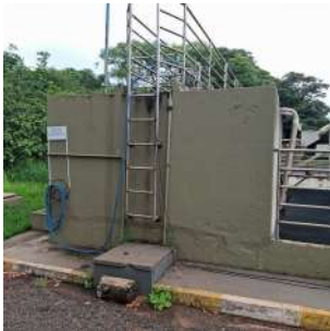
Foto 2 - Reator de batelada da ETE Bueno de Andrade em Araraquara
