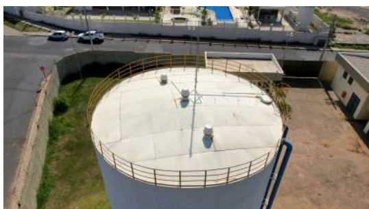
Foto 9 - Tampa de inspeção e tubulação de ventilação no Reservatório São Rafael em Araraquara
