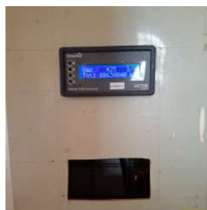
Foto 2 - Macromedidor de entrada na ETA Fonte em Araraquara
