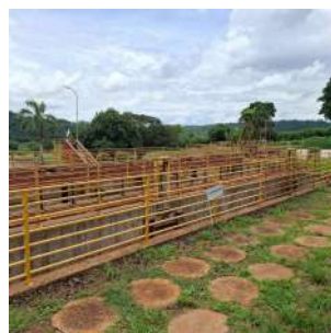
Foto 8 - Guarda-corpos da ETE Araraquara
