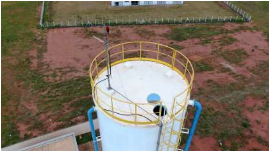
Foto 1 - Tampa de inspeção aberta no R 52 Ipanema ZB em Araraquara
