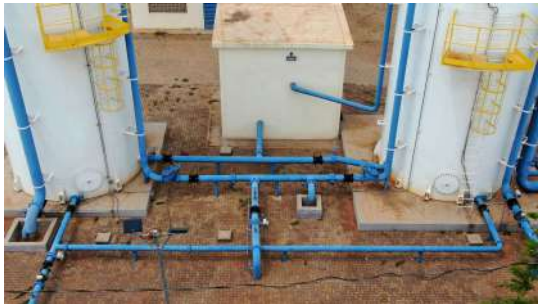
Foto 3 - Tubulações de entrada, saída e extravasamento no Reservatório 51 Ipanema ZB em Araraquara
