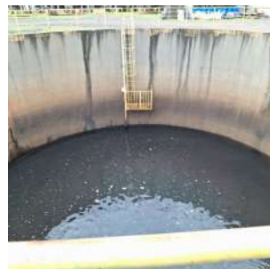
Foto 2 - Tanque de lodo na ETA Fonte em Araraquara
