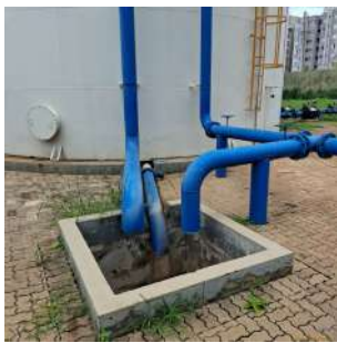
Foto 3 - Tubulações de entrada, saída e extravasamento do Reservatório São Rafael em Araraquara
