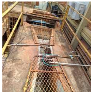
Foto 24 - Calha Parshall da ETA Paiol em Araraquara
