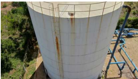
Foto 1 - Vazamento na estrutura do Reservatório Flora em Araraquara
