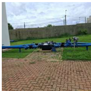
Foto 3 - Booster do Poço São Rafael em Araraquara
