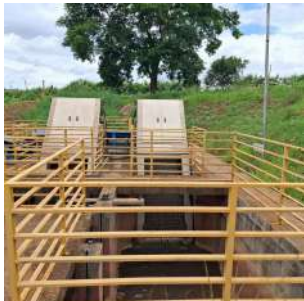
Foto 11 - Peneiras desativadas da ETE Araraquara
