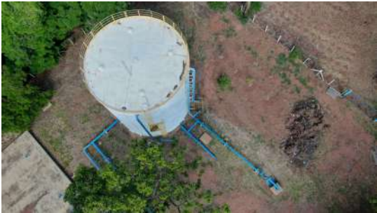
Foto 1 - Tubulações de entrada, saída e extravasamento do Reservatório R46 em Araraquara
