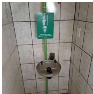
Foto 2 - Chuveiro de emergência na ETA Fonte em Araraquara
