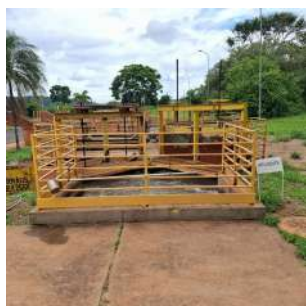
Foto 3 - Entrada do efluente da ETE Araraquara
