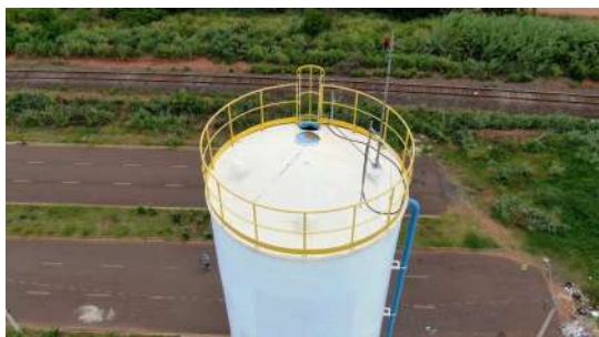
Foto 4 - Para-raios e tubulações de ventilação no R 52 Ipanema ZB em Araraquara
