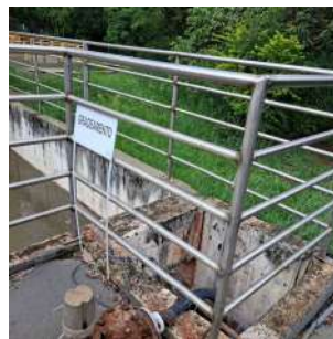
Foto 4 - Gradeamento da ETE Bueno de Andrade em Araraquara
