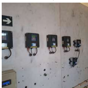
Foto 3 - Macromedidor de entrada na ETA Fonte em Araraquara
