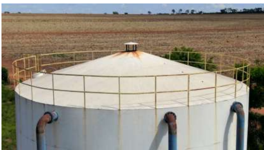
Foto 1 - Inexistência de telas de proteção na tubulação de ventilação no Reservatório Flora em Araraquara
