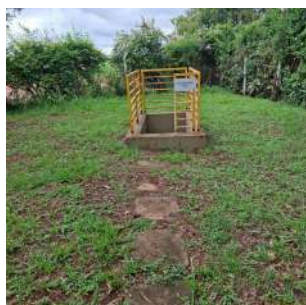
Foto 1 - Calha Parshall na ETE Bueno de Andrade em Araraquara
