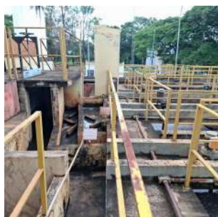
Foto 12 - Entrada de água bruta da ETA Paiol em Araraquara
