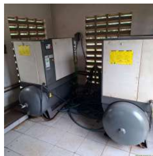
Foto 6 - Sala de centrifugas da ETE Bueno de Andrade em Araraquara
