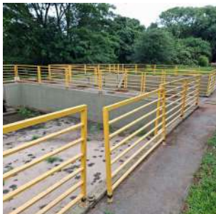
Foto 1 - Guarda-corpo não fixado ao solo na ETE Bueno de Andrade em Araraquara
