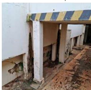
Foto 3 - Vazamento na estrutura do filtro na ETA Fonte em Araraquara
