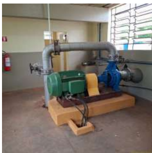
Foto 13 - Sala de bombas na ETA Fonte em Araraquara
