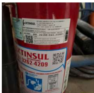
Foto 1 - Extintor de incêndio na ETE Bueno de Andrade em Araraquara
