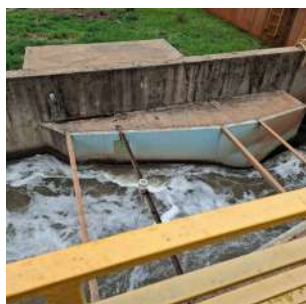
Foto 7 - Calha Parshall da ETE Araraquara
