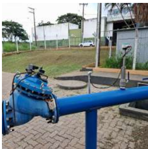
Foto 4 - Válvula de atuação no Poço Santa Lucia em Araraquara
