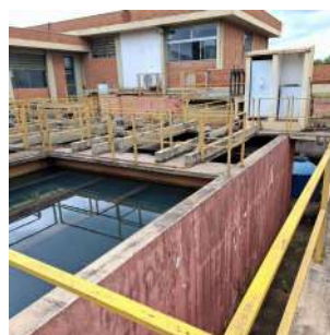
Foto 20 - ETA Paiol em Araraquara
