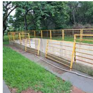
Foto 2 - Guarda-corpo não fixado ao solo na ETE Bueno de Andrade em Araraquara
