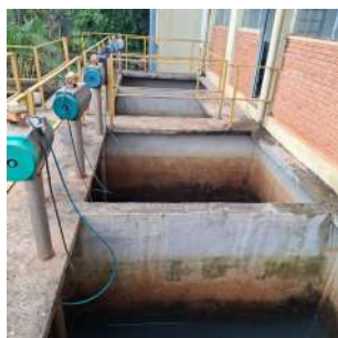
Foto 17 - Filtros da ETA Paiol em Araraquara
