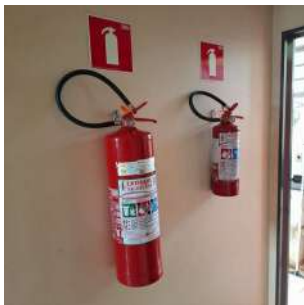
Foto 1 - Extintor de incêndio na ETE Araraquara
