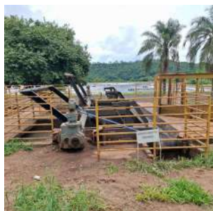
Foto 5 - Saída do efluente da ETE Araraquara
