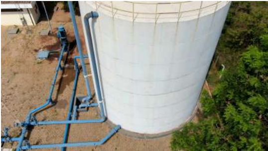
Foto 1 - Tubulações de entrada, saída e extravasamento do Reservatório Flora em Araraquara
