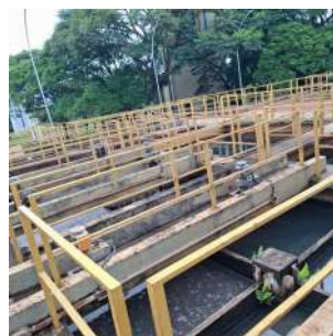
Foto 13 - Floculador da ETA Paiol em Araraquara
