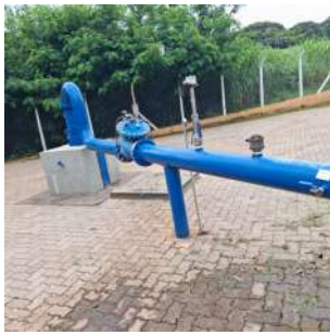
Foto 6 - Medidor de vazão no Poço Santa Lucia em Araraquara
