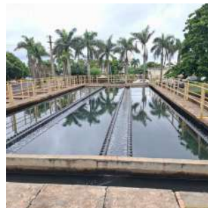
Foto 4 - Decantador na ETA Fonte em Araraquara
