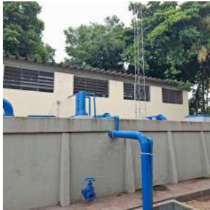
Foto 8 - Poço Santa Lucia em Araraquara
