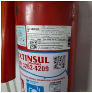
Foto 1 - Extintor de incêndio no Poço Santa Lucia em Araraquara
