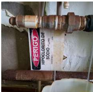
Foto 3 - Dosagem de produtos químicos na ETA Fonte em Araraquara
