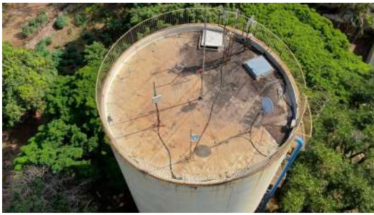
Foto 1 - Tampa aberta no Reservatório R5 em Araraquara
