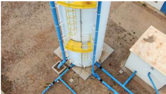
Foto 1 - Tubulações de entrada, saída e extravasamento no Reservatório 51 Ipanema ZB em Araraquara
