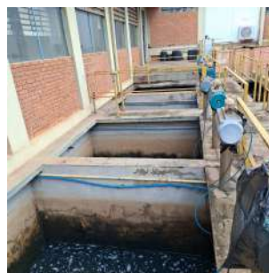
Foto 18 - Filtros da ETA Paiol em Araraquara
