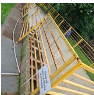
Foto 9 - Câmara de contato para cloração da ETE Bueno de Andrade em Araraquara
