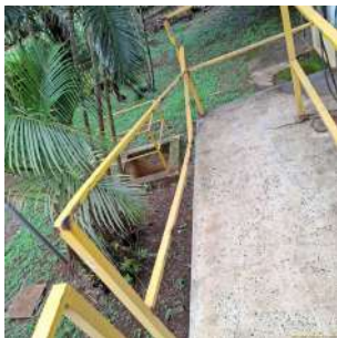
Foto 3 - Guarda-corpo quebrado da ETA Paiol em Araraquara
