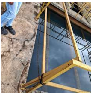
Foto 1 - Guarda-corpos não fixados no solo da ETA Paiol em Araraquara
