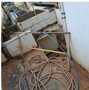
Foto 1 - Guarda-corpo não fixado ao solo na ETA Fonte em Araraquara
