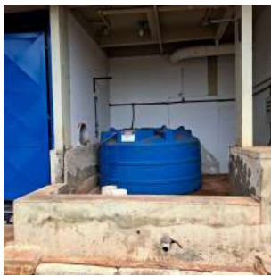
Foto 3 - Tanques de produtos químicos da ETA Paio em Araraquara
