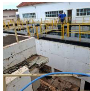
Foto 2 - Guarda-corpo não fixado ao solo na ETA Fonte em Araraquara
