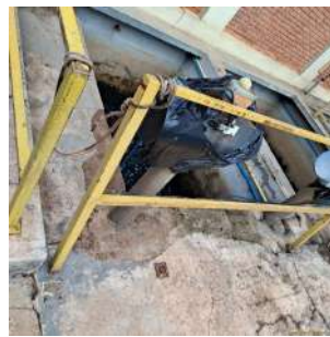
Foto 2 - Guarda-corpos não fixados no solo da ETA Paiol em Araraquara
