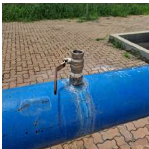
Foto 1 - Tomada de água bruta do Poço São Rafael em Araraquara
