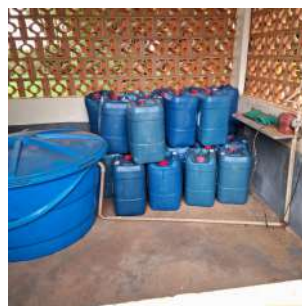
Foto 2 - Produtos químicos estocados na ETE Bueno de Andrade em Araraquara
