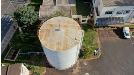
Foto 1 - Para-raios do Reservatório R39 em Araraquara
