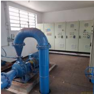
Foto 2 - Bomba da Estação elevatória de água tratada do Santa Lucia II em Araraquara
