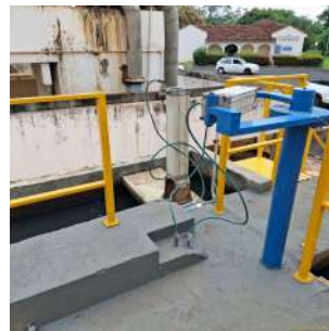
Foto 7 - Moduladores na ETA Fonte em Araraquara
