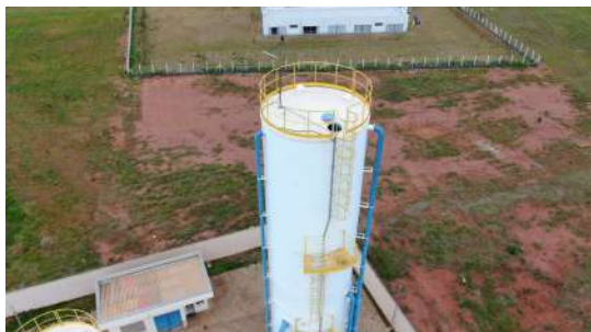
Foto 1 - Guarda-corpos do R 52 Ipanema ZB em Araraquara
