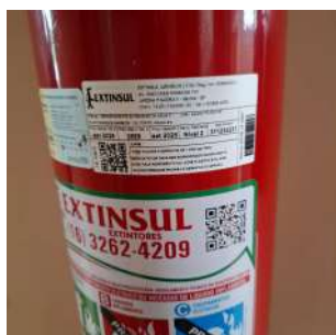
Foto 1 - Extintor de incêndio na ETE Araraquara
