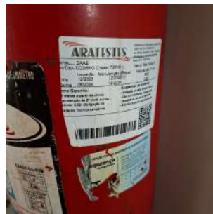
Foto 2 - Extintor de incêndio da ETA Paiol em Araraquara
