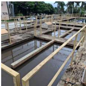
Foto 3 - Floculador na ETA Fonte em Araraquara
