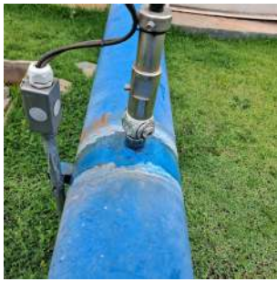
Foto 1 - Vazamento no medidor de vazão no Booster São Rafael em Araraquara
