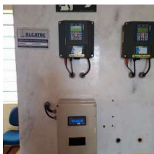
Foto 1 - Macromedidor de entrada na ETA Fonte em Araraquara
