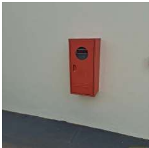
Foto 1 - Extintor de incêndio do Poço São Rafael em Araraquara
