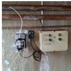
Foto 6 - Dosadora de produtos químicos da ETA Paio em Araraquara
