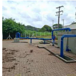
Foto 9 - Poço Santa Lucia em Araraquara
