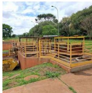
Foto 2 - Entrada do efluente da ETE Araraquara
