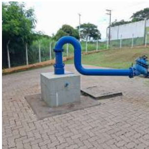
Foto 3 - Poço Santa Lucia em Araraquara
