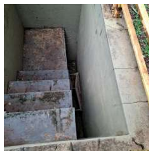
Foto 2 - Calha Parshall na ETE Bueno de Andrade em Araraquara
