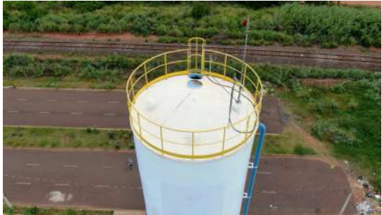
Foto 5 - Para-raios e tubulações de ventilação no Reservatório 51 Ipanema ZB em Araraquara
