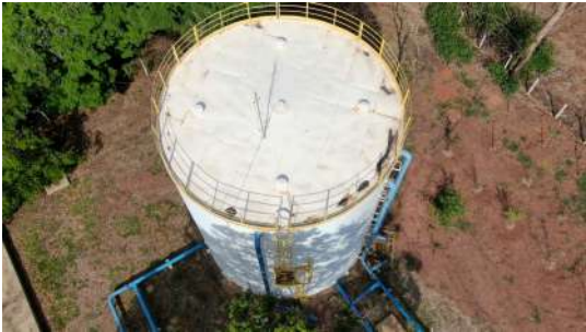
Foto 2 - Tubulações de ventilação do Reservatório R46 em Araraquara
