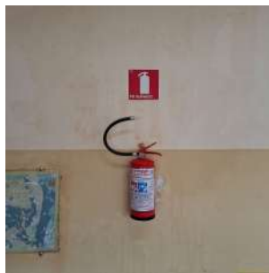
Foto 2 - Extintor de incêndio na ETA Fonte em Araraquara
