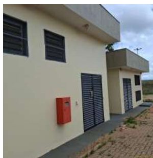
Foto 2 - Estações elétricas do Poço São Rafael em Araraquara
