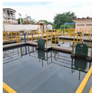
Foto 6 - Filtros na ETA Fonte em Araraquara
