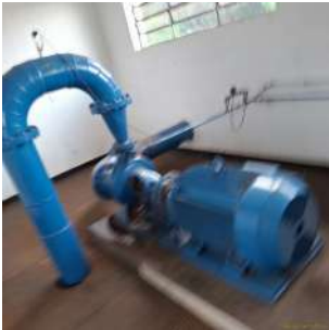
Foto 1 - Bomba da Estação elevatória de água tratada do Santa Lucia II em Araraquara
