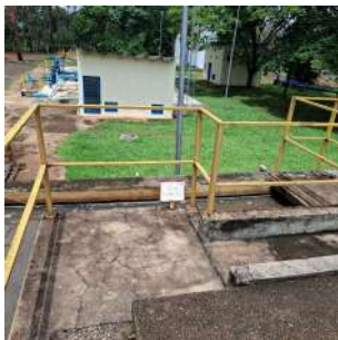
Foto 23 - Floculador da ETA Paiol em Araraquara
