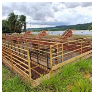
Foto 1 - Guarda-corpo oxidado da ETE Araraquara
