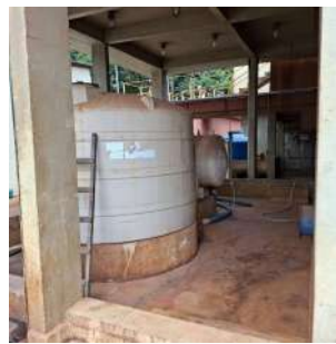
Foto 4 - Tanques de produtos químicos da ETA Paio em Araraquara
