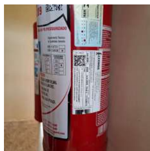
Foto 2 - Extintor de incêndio na ETE Araraquara
