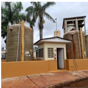
Foto 15 - Produtos químicos utilizados na ETA Fonte em Araraquara
