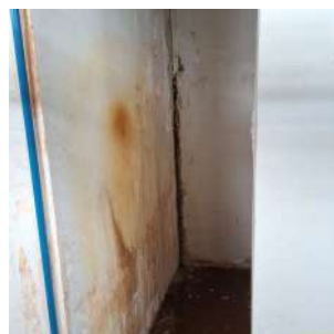
Foto 2 - Vazamento na sala de bombas da ETA Paiol em Araraquara
