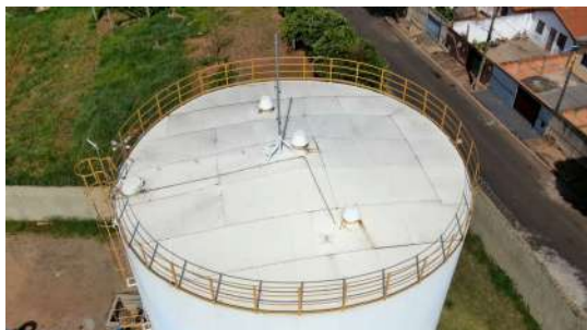
Foto 6 - Tampa de inspeção e tubulação de ventilação no Reservatório São Rafael em Araraquara
