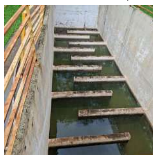
Foto 10 - Câmara de contato para cloração da ETE Bueno de Andrade em Araraquara
