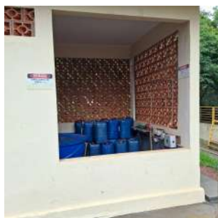
Foto 1 - Produtos químicos estocados na ETE Bueno de Andrade em Araraquara
