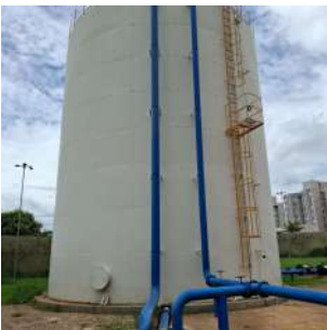
Foto 2 - Tubulações de entrada, saída e extravasamento do Reservatório São Rafael em Araraquara
