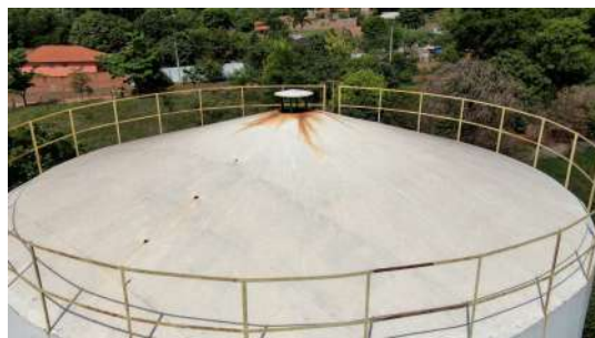
Foto 2 - Inexistência de telas de proteção na tubulação de ventilação no Reservatório Flora em Araraquara
