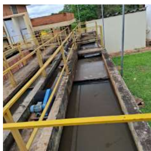
Foto 19 - ETA Paiol em Araraquara
