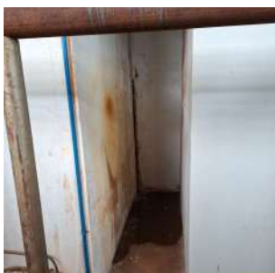
Foto 1 - Vazamento na sala de bombas da ETA Paiol em Araraquara
