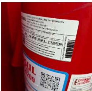
Foto 3 - Extintor de incêndio do Poço São Rafael em Araraquara
