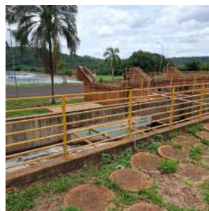
Foto 6 - Saída do efluente da ETE Araraquara
