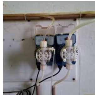
Foto 2 - Dosagem de produtos químicos na ETA Fonte em Araraquara
