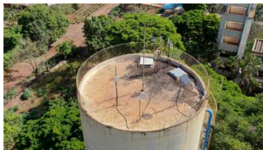
Foto 5 - Para-raios do Reservatório R5 em Araraquara
