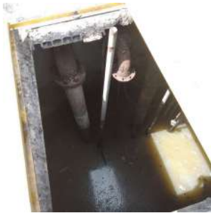
Foto 2 - Tubulações de sucção das bombas do poço.
