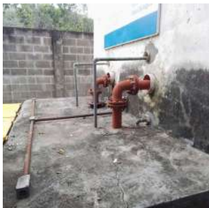
Foto 5 - Tubulações de sucção das bombas.
