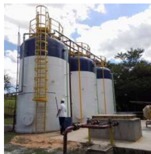
Foto 8 - 3 filtros aerados submersos.
