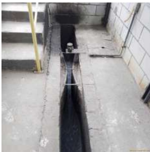
Foto 2 - Calha parshall e medidor de vazão na saída.
