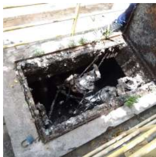
Foto 1 - Sucção das bombas submersíveis.
