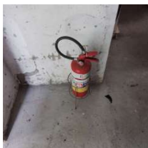
Foto 1 - Extintor na elevatória.
