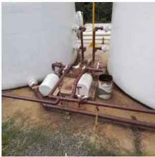
Foto 2 - Pontos para remoção de lodo dos filtros.
