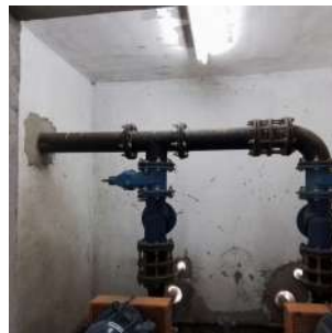
Foto 6 - Recalque das bombas.
