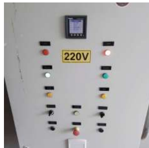
Foto 4 - Acionamento de uma das bombas pelo nível do poço de sucção.
