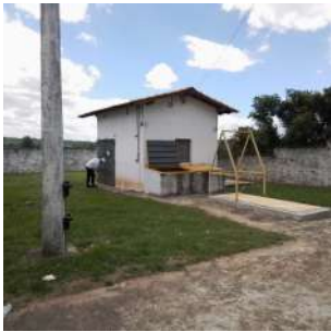
Foto 4 - Casa de bombas da elevatória.
