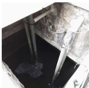
Foto 3 - Recalque das bombas submersíveis.
