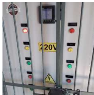
Foto 2 - Identificação das bombas no painel.
