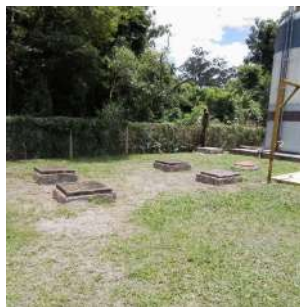
Foto 2 - Sistema de fossas.
