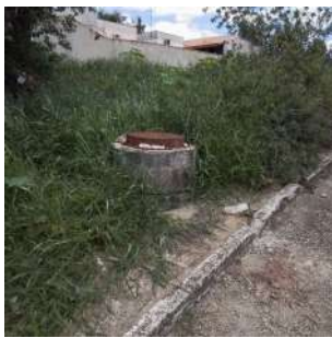
Foto 5 - PV na chegada do efluente à elevatória.
