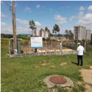
Foto 1 - Visão geral da elevatória.
