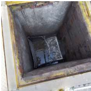
Foto 1 - Cesto peneira da elevatória.
