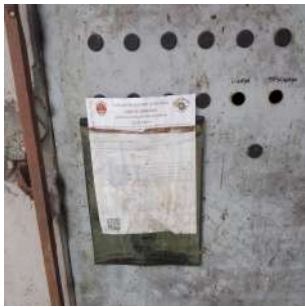
Foto 1 - CLCB da elevatória.
