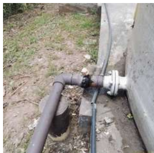
Foto 1 - Vazamento em tubulação do filtro aerado.
