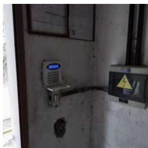
Foto 1 - Alarme da elevatória.
