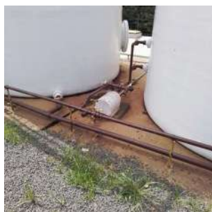
Foto 11 - Bomba de recirculação de lodo.
