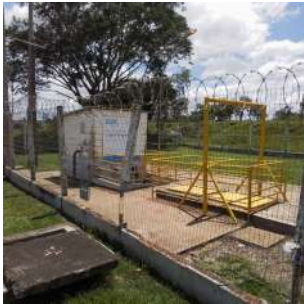
Foto 2 - Visão geral da elevatória.
