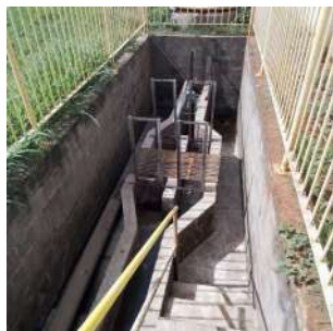
Foto 1 - Gradeamento na caixa de areia.
