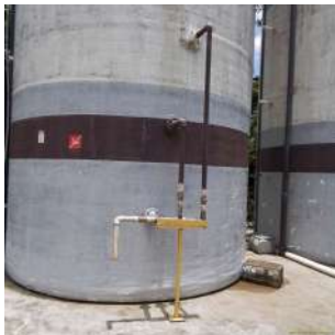
Foto 1 - Tubulação para remoção do lodo no reator UASB, procedimento realizado por caminhão, com o lodo sendo transportado para secagem e tratamento na ETE Flores.
