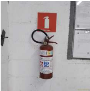
Foto 1 - Extintor na estação.
