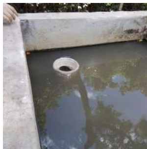
Foto 8 - Saída do tanque de contato.
