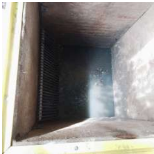
Foto 4 - Gradeamento no poço de chegada do efluente.
