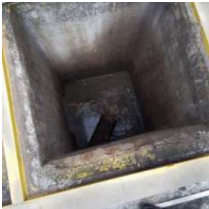
Foto 4 - Poço de entrada do efluente.
