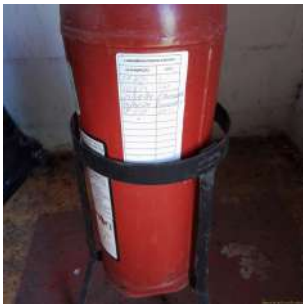
Foto 2 - Inspeções realizadas no extintor.
