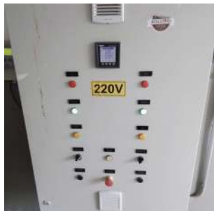
Foto 3 - Painel de comando das bombas, ambas desligadas no instante.
