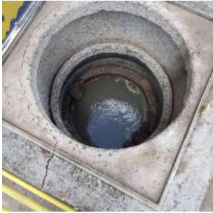
Foto 4 - Entrada do efluente na elevatória.
