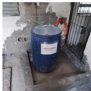
Foto 3 - Armazenamento e dosagem de hipoclorito de sódio.
