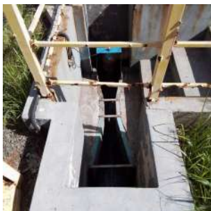
Foto 7 - Calha parshall na elevatória.
