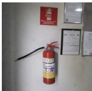
Foto 1 - Extintor na elevatória.
