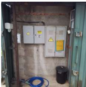
Foto 5 - Painel elétrico da elevatória.
