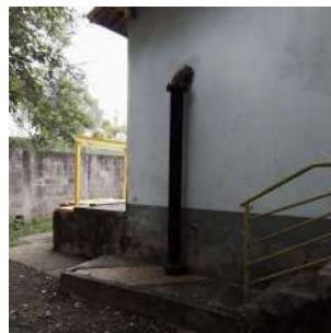
Foto 8 - Recalque da elevatória.
