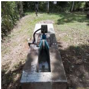
Foto 1 - Calha parshall e medidor de vazão na saída do tanque de contato.
