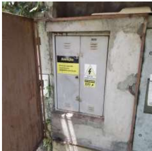
Foto 3 - Painel elétrico da estação.
