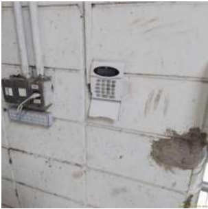
Foto 1 - Alarme na elevatória.
