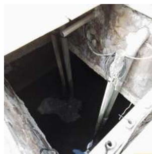
Foto 2 - Poço úmido e tubulação de recalque das bombas.
