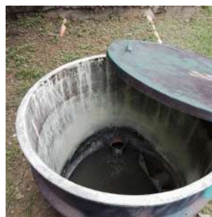
Foto 4 - PV onde o efluente chega à elevatória.
