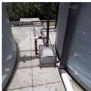
Foto 13 - Bomba de recirculação de lodo.
