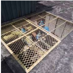
Foto 3 - Barrilete do recalque.
