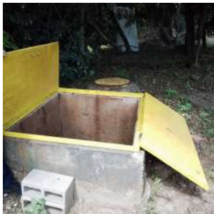
Foto 3 - PV e poço na entrada da ETE
