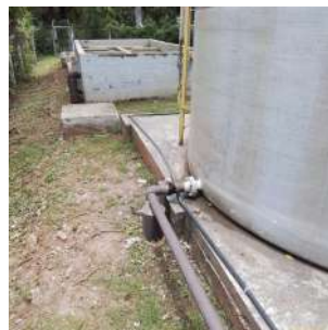
Foto 2 - Tubulação com vazamento verificado.
