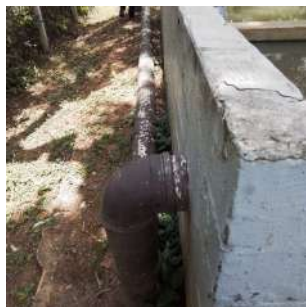
Foto 9 - Tubulação de saída do tanque de contato.
