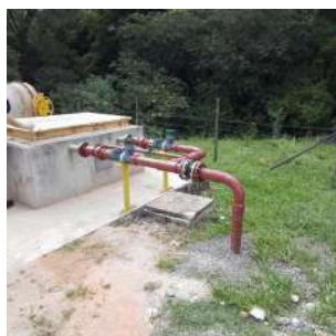
Foto 1 - Recalque das duas bombas submersíveis.
