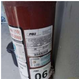
Foto 1 - Manutenção do extintor vencida.
