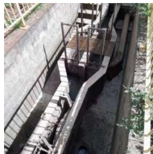
Foto 2 - Gradeamento na caixa de areia.
