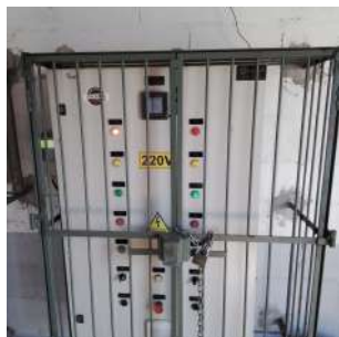
Foto 1 - Painel de comando das bombas.
