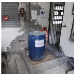
Foto 1 - Tanque para armazenamento de hipoclorito de sódio.
