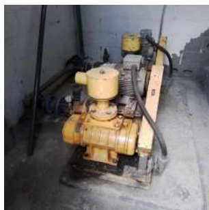
Foto 11 - Sopradores para aeração do filtro.
