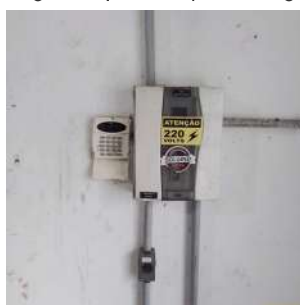
Foto 3 - Alarme na elevatória.
