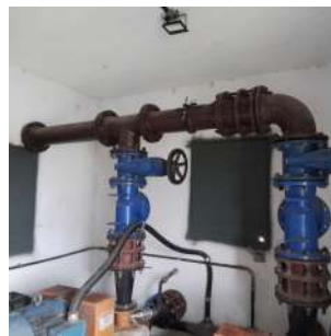
Foto 4 - Recalque das bombas.
