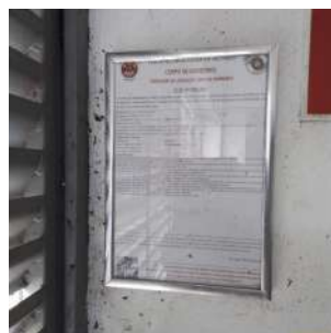
Foto 2 - CLCB da elevatória.
