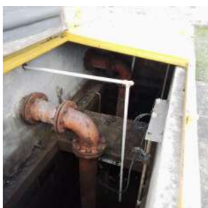
Foto 1 - Sucção das bombas.
