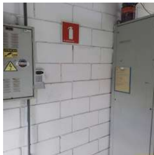
Foto 2 - Placa do extintor.
