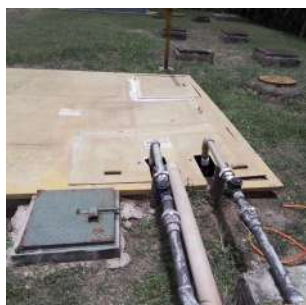
Foto 1 - Recalque das bombas da elevatória.
