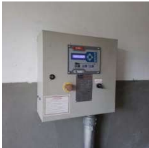
Foto 5 - Painel do gerador.
