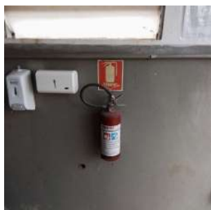
Foto 1 - Extintor na casa de bombas.
