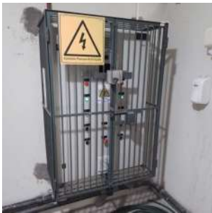
Foto 4 - Painel de comando das bombas.
