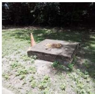
Foto 5 - PV na entrada do efluente na elevatória.
