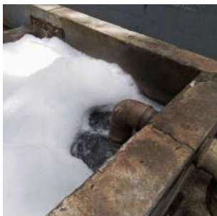
Foto 7 - Entrada do efluente no tanque de contato após o filtro aerado.
