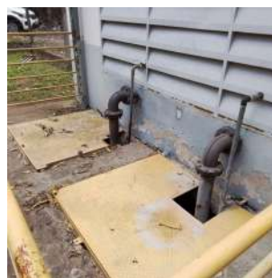
Foto 4 - Tubulações de sucção das bombas.
