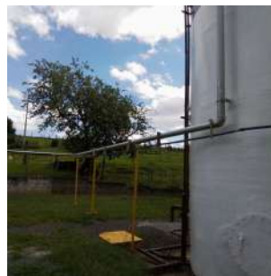
Foto 16 - Tubulação para aeração, proveniente do soprador.
