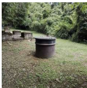
Foto 3 - PV na chegada do efluente à elevatória.
