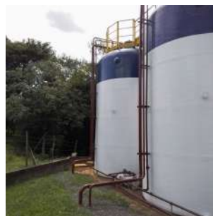
Foto 10 - Tubulações de entrada do efluente e de recirculação nos filtros.
