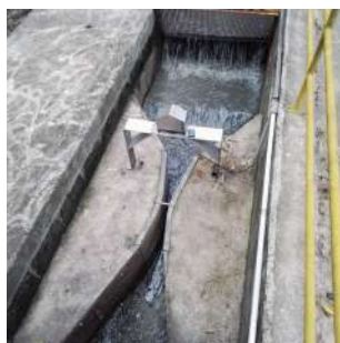
Foto 3 - Calha parshall com medidor de vazão.
