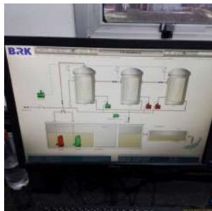
Foto 26 - Monitoramento da ETE a partir do CCO. Observa-se status das bombas e sopradores.
