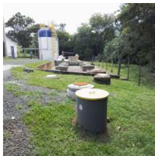
Foto 5 - Vista interna da elevatória: sistema de fossas sépticas e filtros aerados.
