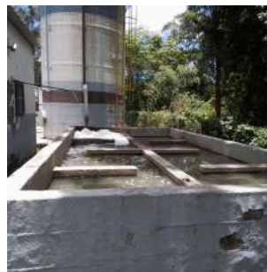
Foto 10 - Tanque de contato e aplicação de cloro. Atrás, filtro aerado.
