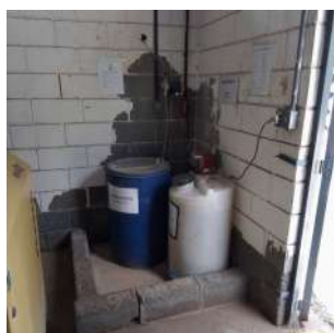
Foto 1 - Armazenamento e dosagem de hipoclorito de sódio.
