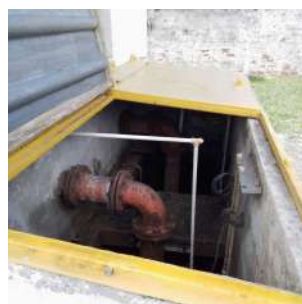
Foto 2 - Tubulações de sucção.
