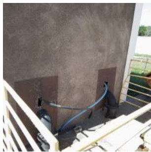
Foto 1 - Sucção das bombas.
