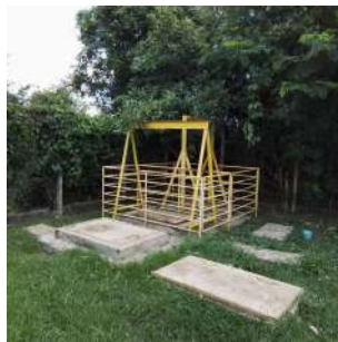
Foto 1 - Estrutura para manutenção nos poços da estação elevatória.
