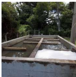
Foto 6 - Tanque de contato com aplicação de hipoclorito de sódio.
