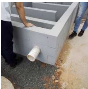
Foto 18 - Tubo para entrada do efluente no tanque de contato, quando estiver finalizado.
