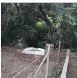
Foto 20 - Lançamento final do efluente.
