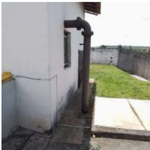
Foto 2 - Recalque da elevatória.
