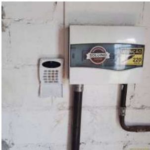
Foto 2 - Alarme da elevatória.
