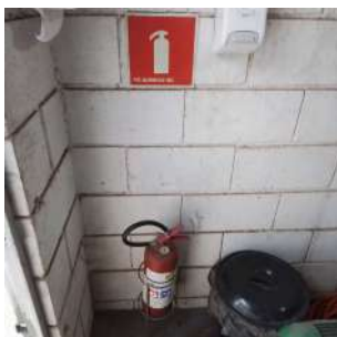
Foto 1 - Extintor na elevatória.
