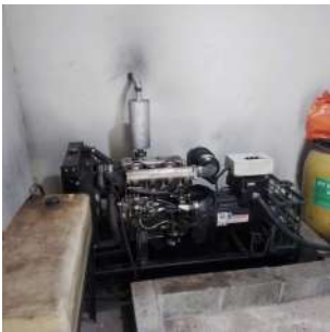
Foto 3 - Gerador da elevatória.
