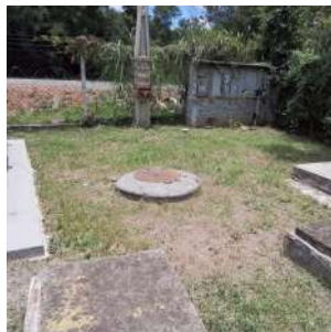
Foto 3 - PV na entrada da estação, que recebe o efluente.
