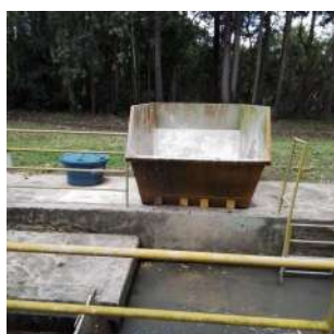
Foto 1 - Caçamba para remoção de sólidos retidos no gradeamento.
