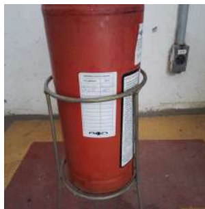
Foto 2 - Inspeções realizadas no extintor.
