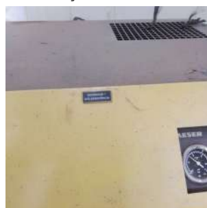
Foto 23 - Identificação do soprador.
