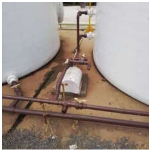
Foto 1 - Ponto para remoção de lodo.
