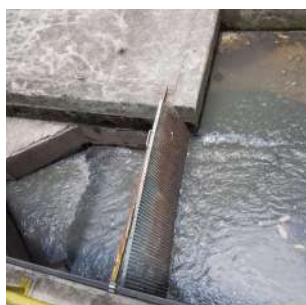
Foto 1 - Gradeamento em boas condições de limpeza e operação.
