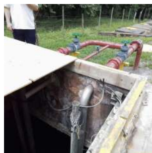
Foto 4 - Recalque das bombas, encaminhando o efluente para os filtros aerados.
