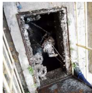
Foto 2 - Sucção das bombas.
