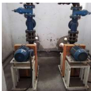
Foto 1 - Conjuntos motobombas centrífugas.
