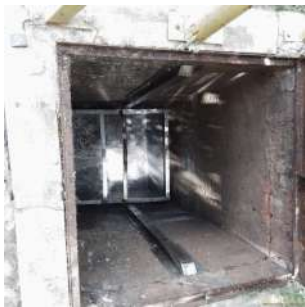
Foto 1 - Cesto peneira no poço de entrada do efluente.
