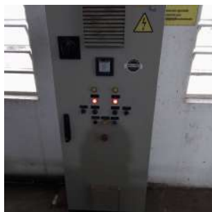
Foto 3 - Pannel de comando das bombas, ambas ligadas na ocasião.
