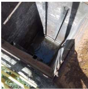
Foto 5 - Poço do cesto peneira, que estava submerso no momento da Fiscalização.
