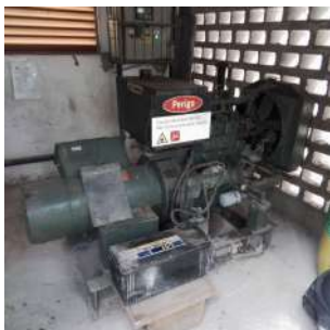
Foto 7 - Gerador da elevatória.
