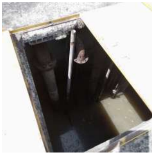
Foto 1 - Duas bombas submersíveis no poço úmido.
