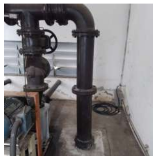
Foto 2 - Recalque das bombas.
