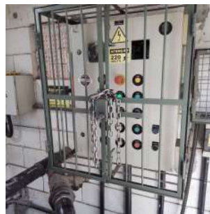
Foto 2 - Painele de comando das bombas.
