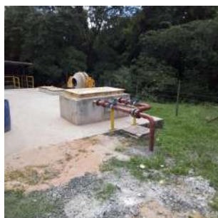
Foto 1 - Tubulação de recalque da elevatória.
