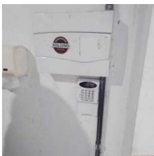
Foto 1 - Alarme na elevatória.
