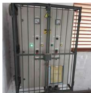
Foto 2 - Pannel de comando das bombas.
