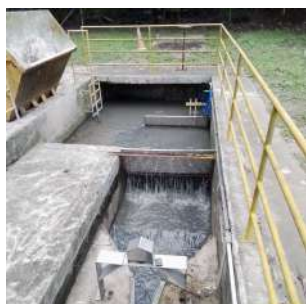
Foto 1 - Gradeamento da elevatória na entrada do efluente.
