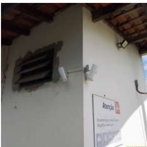
Foto 1 - Sensores de presença do sistema de alarme.
