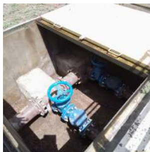
Foto 3 - Barrilete do recalque.
