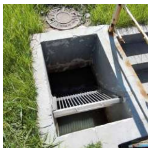
Foto 1 - Gradeamento preliminar em boas condições.
