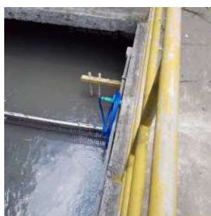
Foto 2 - Mangueira para limpeza do gradeamento.
