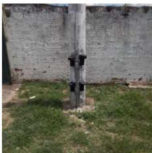
Foto 3 - Sensores do sistema de alarme.
