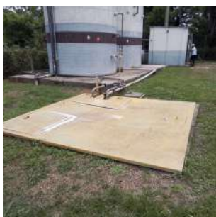
Foto 1 - Elevatória que bombeia o efluente para o reator UASB, após passagem pelas fossas.
