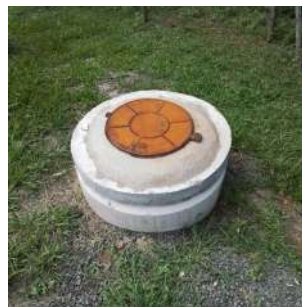
Foto 6 - PV que recebe recirculação de lodo e de vazão excedente.
