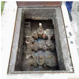
Foto 1 - Caixa do barrilete necessita de limpeza.
