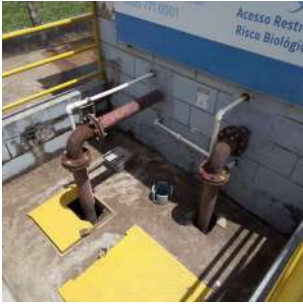
Foto 3 - Tubulação de sucção das bombas.
