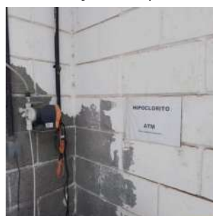
Foto 3 - Bomba dosadora de hipoclorito de sódio.
