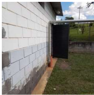
Foto 24 - Saída da tubulação do soprador.
