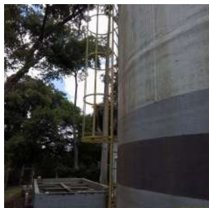
Foto 1 - Escada no filtro aerado.
