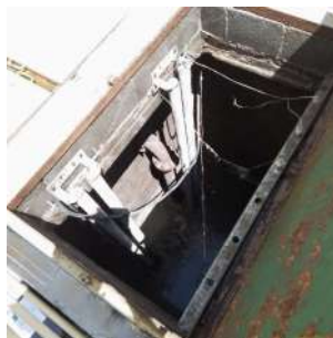
Foto 2 - Tubo de sucção das bombas.
