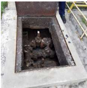
Foto 2 - Barrilete das bombas submersíveis.
