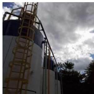
Foto 17 - Acima, tubulação proveniente do soprador.
