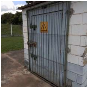
Foto 2 - Grade na porta de acesso à edificação que abriga o painel de comando das bombas.
