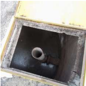
Foto 3 - Poço de sucção.
