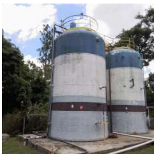
Foto 4 - Reator UASB à esquerda e filtro aerado à direita.
