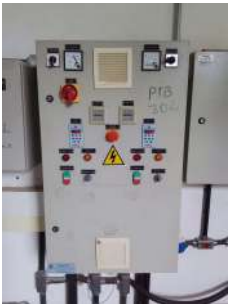
Foto 1 - Painele de controle do poço.
