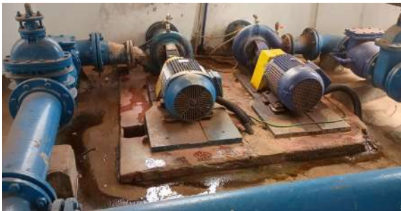
Foto 1 - Situação do piso da elevatória.
