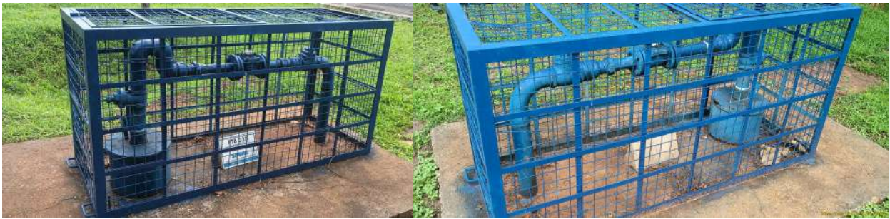
Foto 3 - Grade de proteção do poço.
