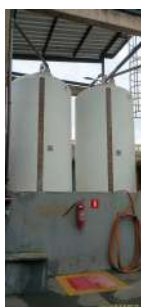
Foto 7 - Tanques de flúor.
