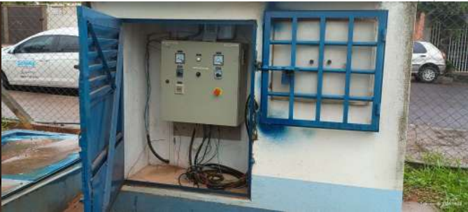
Foto 12 - Painel elétrico e de comando.
