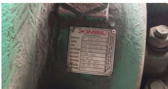
Foto 30 - Placa de especificações técnicas da bomba do conjunto motobomba 3 Boa Vista.
