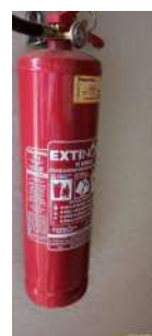
Foto 2 - Validade de um dos extintores de incêndio da EEAT.
