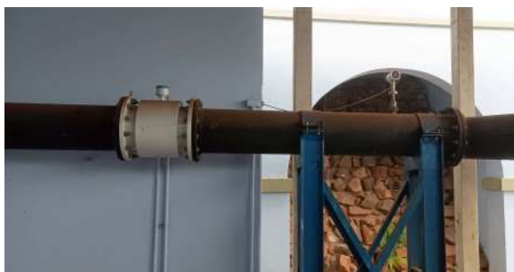
Foto 5 - Medidor de vazão e pressão na adutora de recalque do Alto Alegre.
