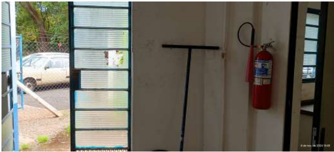
Foto 1 - Extintor de incêndio dentro da EEAT Maceno.
