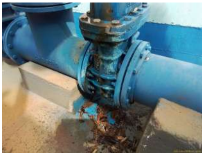
Foto 1 - Vazamento na tubulação de chegada no reservatório.
