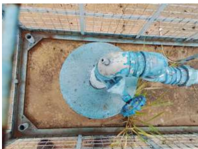
Foto 1 - Estrutura para coleta de água.
