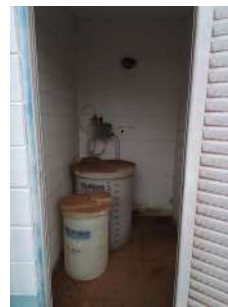
Foto 2 - Tanque de armazenamento de produto químico e dosagem de produto químico.
