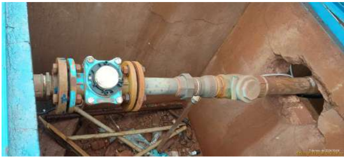
Foto 6 - Macromedidor do poço.
