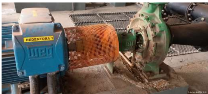
Foto 3 - Conjunto motobomba 1 Redentora
