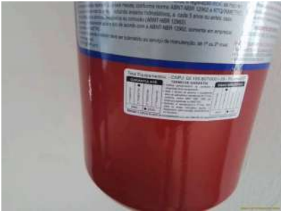
Foto 5 - Validade de um dos extintores de incêndio da EEAT.
