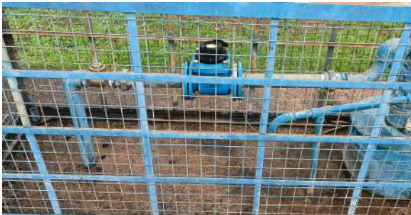
Foto 5 - Cavalete do poço e macromedidor.
