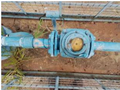
Foto 1 - Macromedidor do poço.
