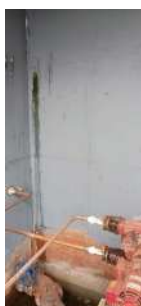
Foto 3 - Vazamentos na alvenaria do canal de água bruta (canal da calha Parshall).
