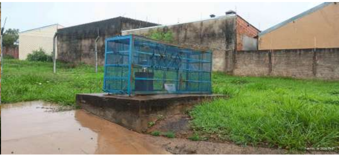
Foto 2 - Grade de proteção do poço.
