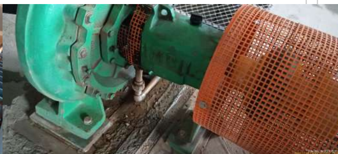
Foto 6 - Detalhe da drenagem do conjunto motobomba 1 Diniz.
