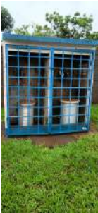
Foto 4 - Abrigo dos tanques de produtos químicos e bombas dosadoras.
