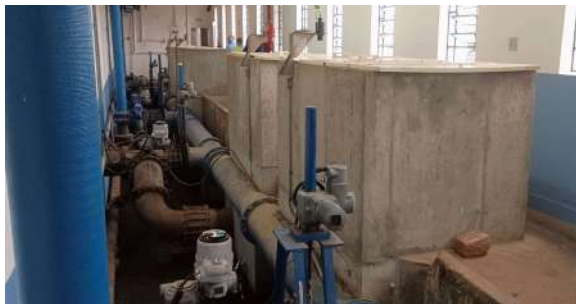
Foto 1 - Ausência de guarda-corpos.
