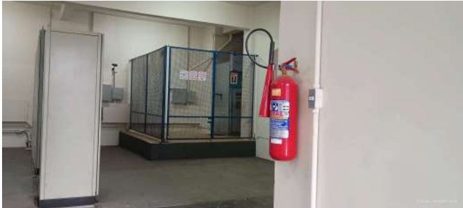
Foto 5 - Painel elétrico do Poço e extintor de incêndio do local.
