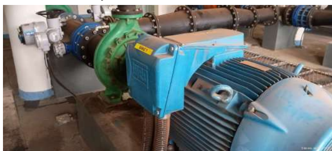
Foto 22 - Conjunto motobomba 1 Diniz.
