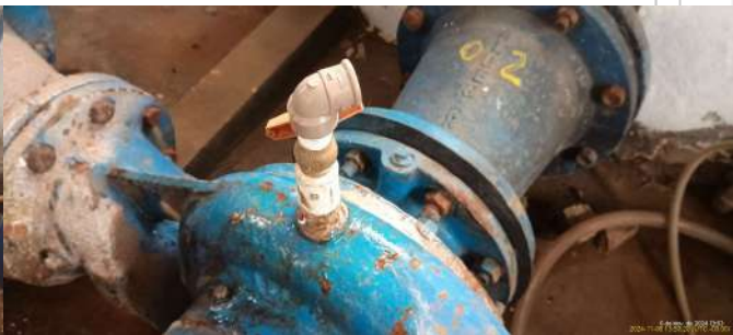
Foto 2 - Detalhe do local do vazamento.
