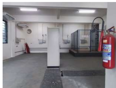
Foto 6 - Interior do abrigo dos painéis elétricos e de comando.
