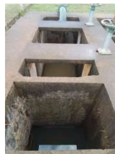
Foto 6 - Tanque de chegada de água da captação provisória.
