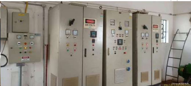
Foto 4 - Painéis elétricos e de comando da EEAT.
