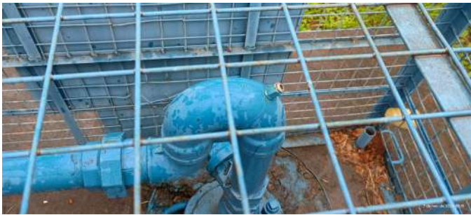
Foto 1 - Ponto de tomada de água bruta.
