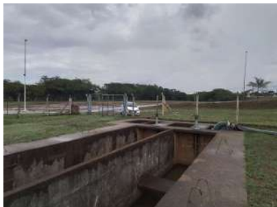
Foto 1 - Vista geral das caixas de areia e de gradeamento grosseiro.
