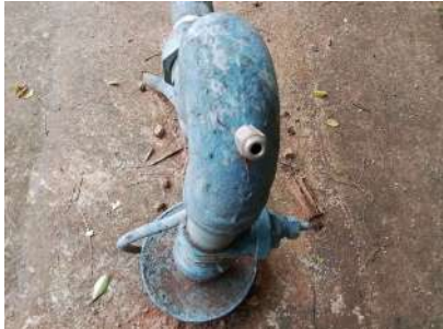
Foto 1 - Estrutura para coleta de água.
