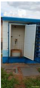
Foto 2 - Tanque de armazenamento e dosagem de Hipoclorito de Sódio ou Ácido Fluossilícico ou Ácido Fluossilícico.
