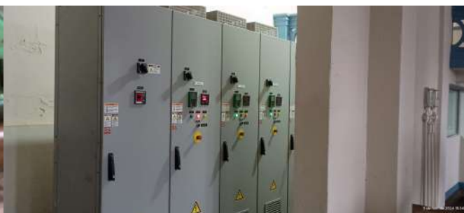
Foto 25 - Painéis elétricos e de comando do Prédio 1 da EEAT.
