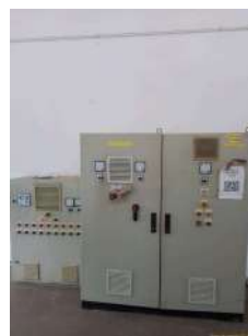
Foto 6 - Painéis de controle do poço.
