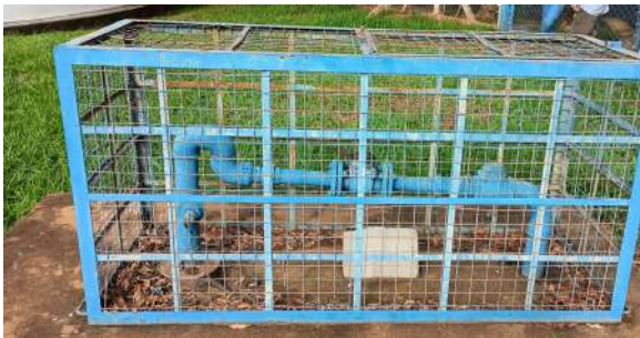
Foto 3 - Grade de proteção do poço.
