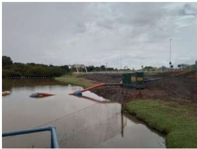
Foto 9 - Conjunto gerador utilizado para captação provisória.
