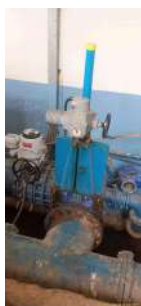
Foto 1 - Vazamento em registro na tubulação pós filtração.
