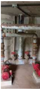
Foto 2 - Barrilete de recalque da EEAT.
