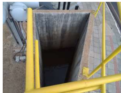
Foto 2 - Um dos tanques de chegada da água bruta.
