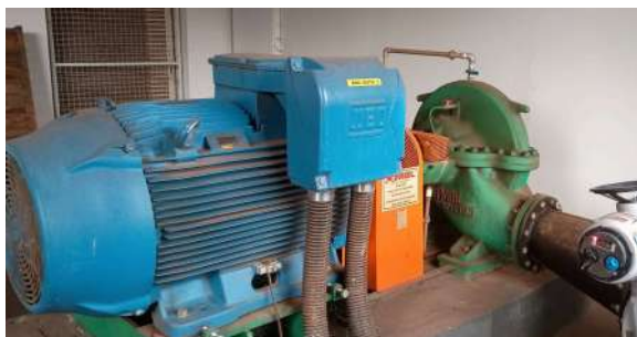
Foto 28 - Conjunto motobomba 3 Boa Vista.
