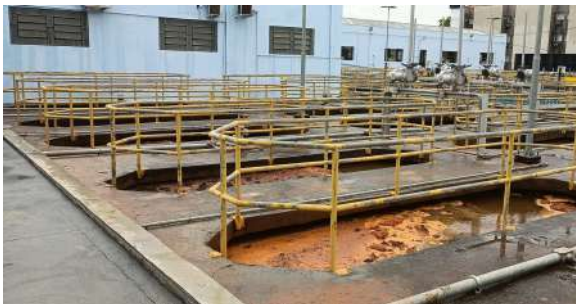
Foto 24 - Unidades de floculação.
