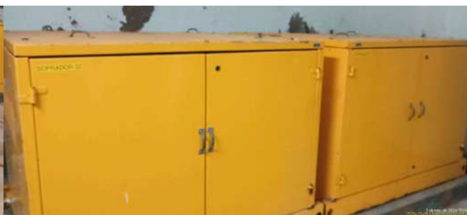
Foto 40 - Sopradores de lavagem dos filtros.
