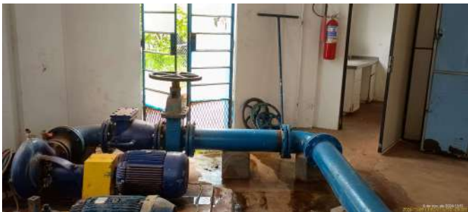
Foto 5 - Vista geral interna da EEAT.
