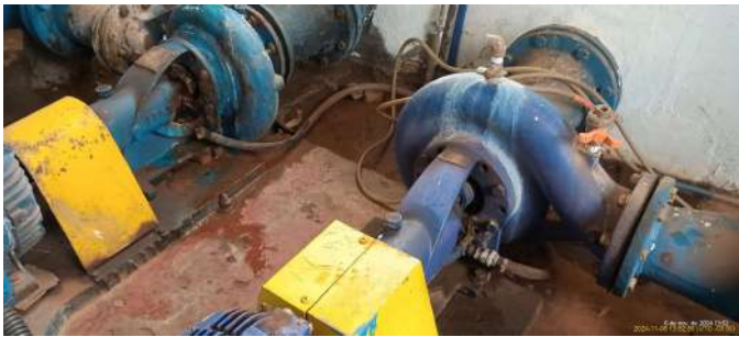
Foto 3 - Situação do piso da elevatória.
