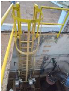
Foto 1 - Guarda-corpo na parte inferior da escada rompido.
