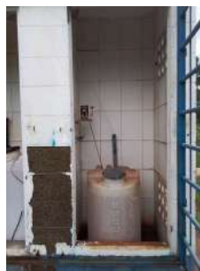
Foto 2 - Tanque de armazenamento e dosagem de produtos químicos.
