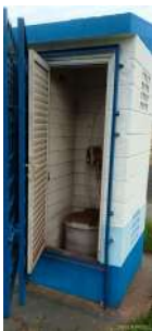
Foto 2 - Abrigo dos tanques de produtos químicos e bombas dosadoras no CR Castelinho.
