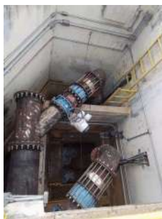
Foto 3 - Um dos tanques de chegada de água bruta e sucção para bombeamento.
