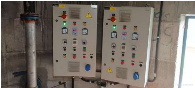
Foto 5 - Painéis elétricos e de comando da EEAT.
