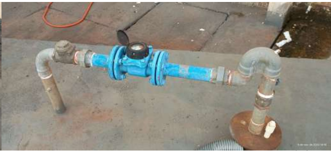
Foto 6 - Cavalete do poço.
