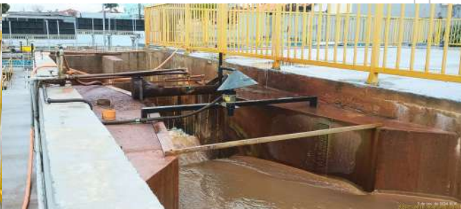
Foto 23 - Macromedidor de entrada (início do tratamento).
