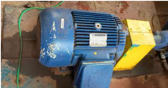
Foto 3 - Conjunto motobomba 01 (reformado) da EEAT.
