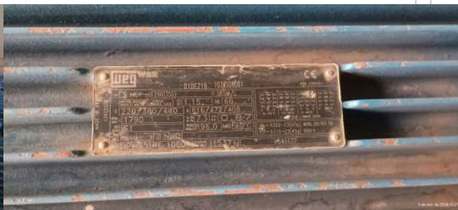
Foto 14 - Placa de especificações técnicas do motor do conjunto motobomba 1 Boa Vista.
