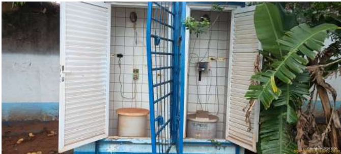
Foto 7 - Abrigos dos tanques de produtos químicos e bombas dosadoras.
