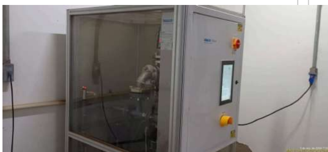
Foto 43 - Gerador de dióxido de cloro.
