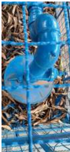
Foto 1 - Ponto de tomada de água bruta.
