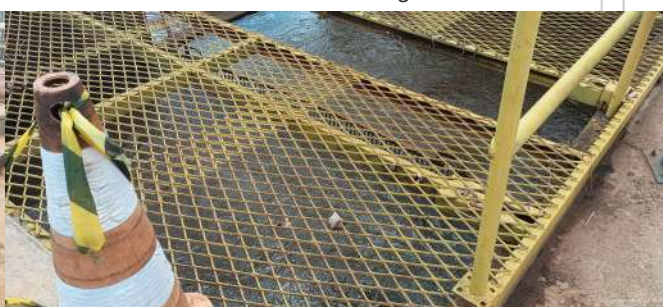
Foto 5 - Gradeamento com barras fixas.
