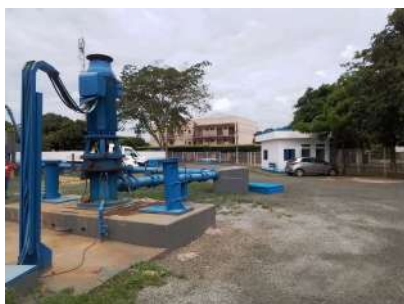
Foto 3 - Vista geral do local onde se situa o poço.
