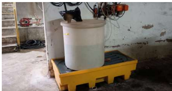
Foto 4 - Tanque de armazenamento do ortopolifosfato.
