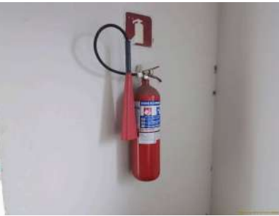
Foto 2 - Extintores de incêndio no Prédio 1.
