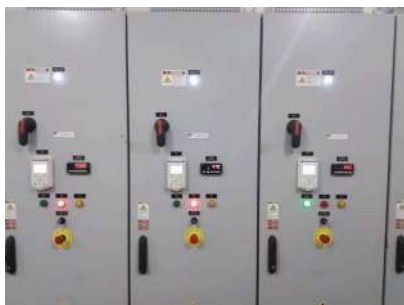
Foto 5 - Painéis de controle das 3 bombas da elevatória.
