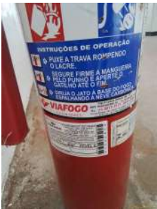
Foto 2 - Manutenção de 2º nível prevista para 2025 e manutenção de 3º nível prevista para 2027.
