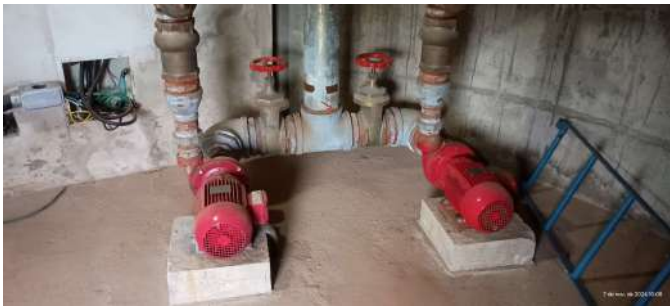
Foto 1 - Conjuntos motobomba da EEAT.
