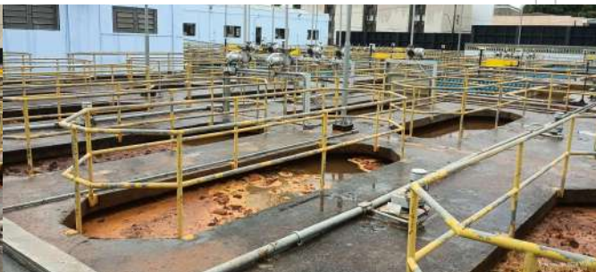
Foto 25 - Unidades de floculação.
