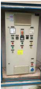
Foto 9 - Painel elétrico e de comando do poço.
