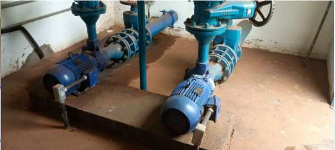
Foto 4 - Conjuntos motobomba da EEAT.
