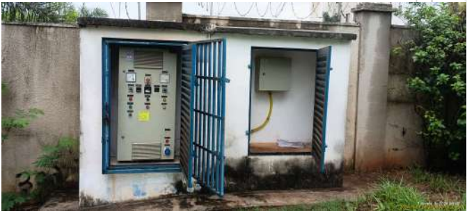
Foto 8 - Abrigo dos painéis elétricos e de comando do poço.
