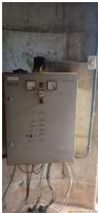
Foto 8 - Painel elétrico e de comando.
