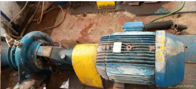
Foto 2 - Conjunto motobomba 02 da EEAT.
