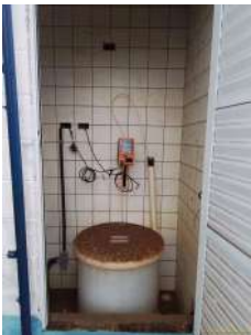
Foto 3 - Tanque de armazenamento e dosagem de ácido fluossilícico ou hipoclorito de sódio.
