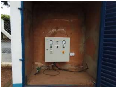
Foto 3 - Vista detalhada do painel de controle.
