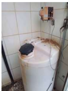
Foto 3 - Tanque de armazenamento e dosagem de produtos químicos e bomba dosadora.
