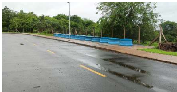
Foto 6 - Poços protegidos para estoque das bombas dos poços PTG.
