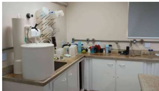
Foto 9 - Laboratório de controle de qualidade da água tratada dos reservatórios e rede de abastecimento.
