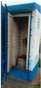
Foto 3 - Tanque de armazenamento e dosagem de Hipoclorito de Sódio ou Ácido Fluossilícico ou Ácido Fluossilícico.
