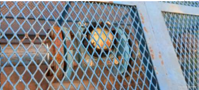
Foto 8 - Macromedidor no cavalete do poço.
