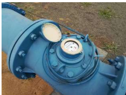
Foto 1 - Macromedidor na tubulação do poço.
