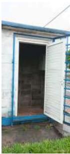
Foto 5 - Abrigo dos tanques de produtos químicos e bombas dosadoras.
