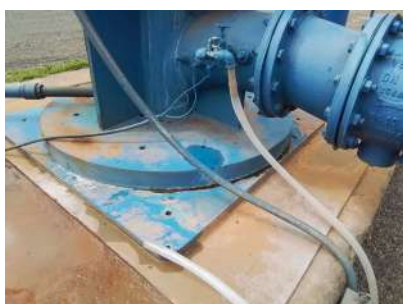
Foto 1 - Torneira para tomada de água.
