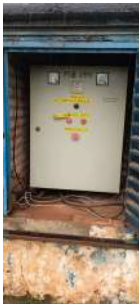
Foto 6 - Painel elétrico e de comando do poço.
