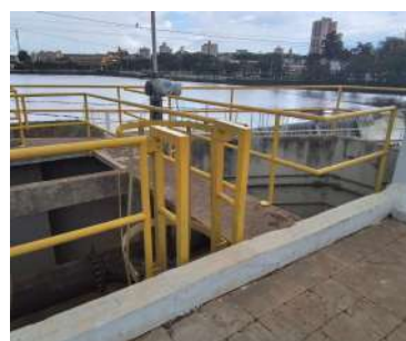
Foto 8 - Vista geral da elevatória com a Represa 1 ao fundo.
