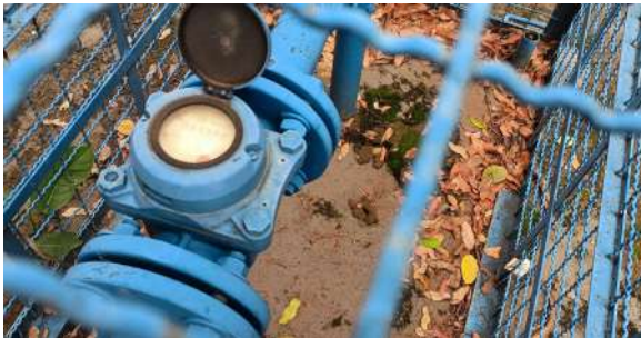
Foto 5 - Macromedidor do poço.
