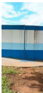
Foto 9 - Tubulação de chegada de parte da água do poço.
