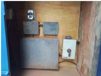
Foto 4 - Vista detalhada do painel elétrico.
