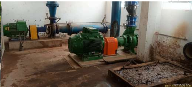
Foto 2 - Conjuntos motobomba instalados na EEAT no momento da fiscalização.
