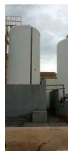
Foto 8 - Tanques de armazenamento de cloreto férrico
