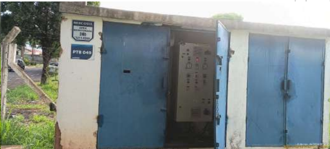
Foto 6 - Abrigo dos painéis elétricos e de comando.
