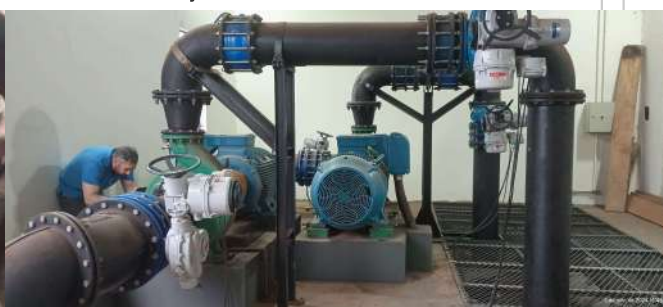
Foto 31 - Conjuntos motobomba Urano.
