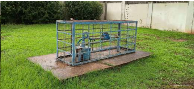
Foto 3 - Grade de proteção do poço.
