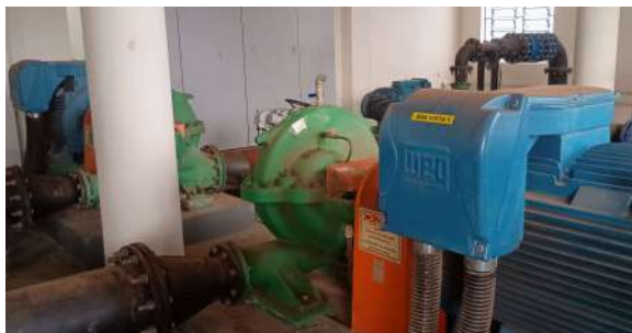
Foto 13 - Conjunto motobomba 1 Boa Vista.
