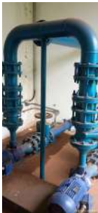
Foto 5 - Barrilete da tubulação de recalque.
