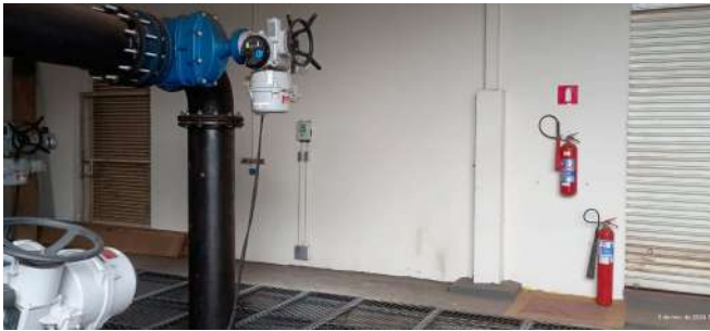
Foto 1 - Extintores de incêndio no Prédio 2.
