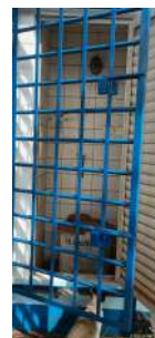
Foto 10 - Um dos tanques de produtos químicos e bomba dosadora.
