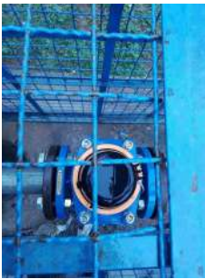
Foto 1 - Macromedidor do poço.
