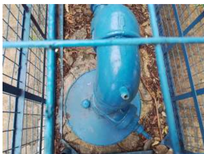
Foto 1 - Estrutura para coleta de água.
