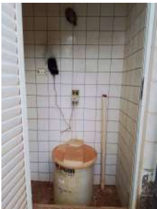
Foto 3 - Tanque de armazenamento e dosagem de Hipoclorito de Sódio ou Ácido Fluossilícico.
