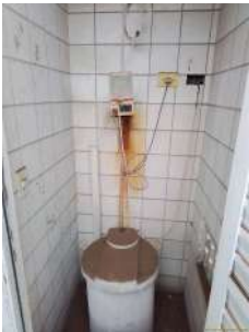
Foto 2 - Tanque de armazenamento e dosagem de ácido fluossilícico ou hipoclorito de sódio.
