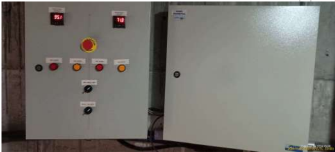
Foto 9 - Painel elétrico e de comando do poço.
