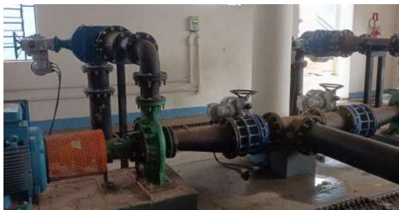
Foto 11 - Conjunto motobomba Maceno.
