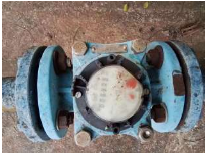
Foto 1 - Macromedidor do poço.
