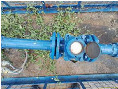
Foto 1 - Macromedidor instalado na tubulação do poço.
