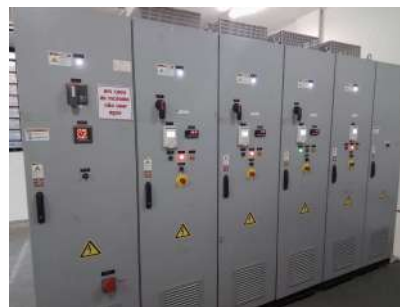
Foto 4 - Painéis elétricos e de controle da elevatória.
