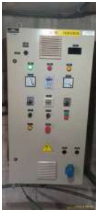
Foto 8 - Painel elétrico e de comando do poço.
