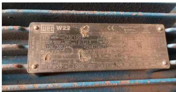
Foto 18 - Placa de especificações técnicas do motor do conjunto motobomba 1 Redentora.
