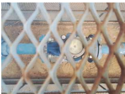
Foto 1 - Macromedidor do poço.
