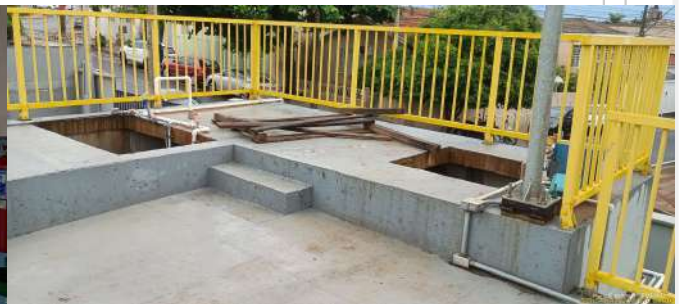
Foto 17 - Local de chegada de água bruta e dosagem inicial de produtos químicos.
