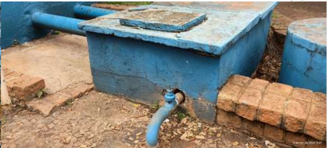
Foto 6 - Caixa de sucção da EEAT Maceno.
