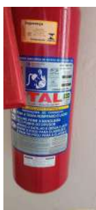
Foto 1 - Validade de um dos extintores de incêndio da EEAT.
