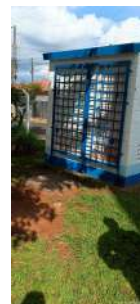
Foto 8 - Casa de produtos químicos e bombas dosadoras.
