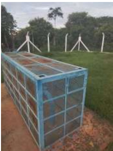
Foto 1 - Local cercado com alambrado e gaiola ao redor do cavalete.
