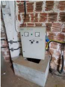
Foto 1 - Painel de controle do poço.
