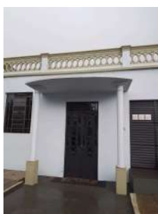
Foto 7 - Vista da entrada do abrigo dos painéis elétricos e de comando da elevatória.
