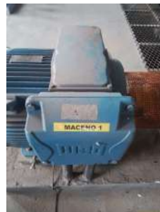
Foto 2 - Conjunto motobomba 1 Maceno.
