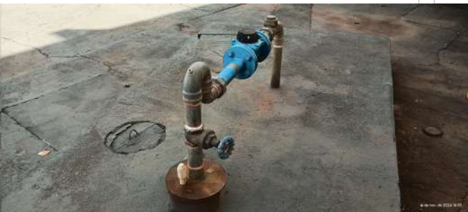
Foto 4 - Cavalete do poço.
