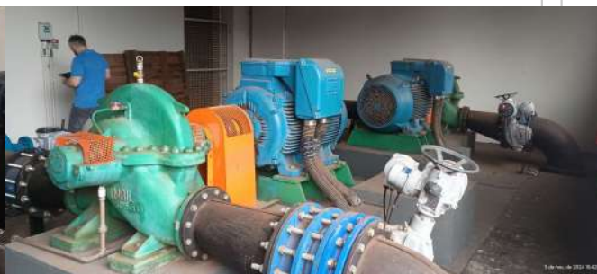
Foto 27 - Conjuntos motobomba Boa Vista 3 e 4 (situados no Prédio 2).
