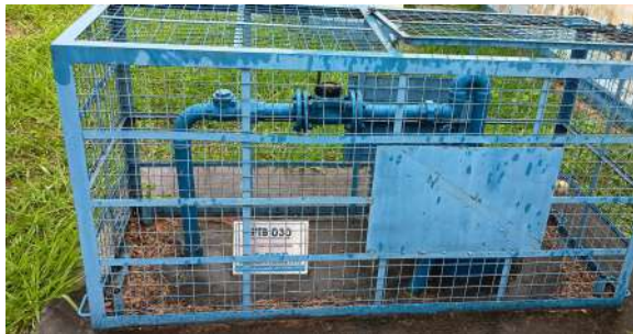
Foto 3 - Grade de proteção do poço e placa de identificação.
