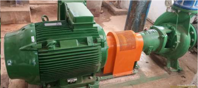
Foto 8 - Conjunto motobomba intermediário da EEAT.
