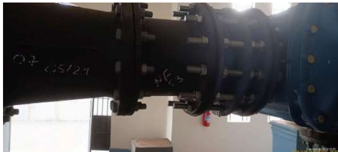
Foto 1 - Local do vazamento na tubulação do conjunto 1 Redentora.
