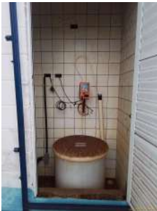
Foto 2 - Tanque de armazenamento e dosagem de hipoclorito de sódio/ácido fluorsilícico.
