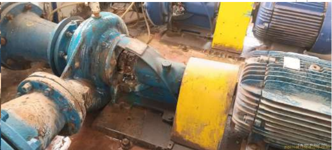
Foto 2 - Água da lubrificação de gaxetas sem drenagem adequada.
