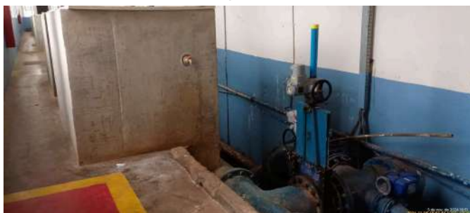
Foto 3 - Ausência de guarda-corpos.
