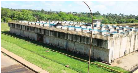
Foto 1 - Reator UASB 1 (a título de exemplo dos vazamentos).
