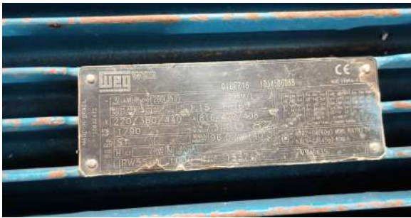
Foto 33 - Placa de especificações técnicas do motor do conjunto motobomba 1 Urano.
