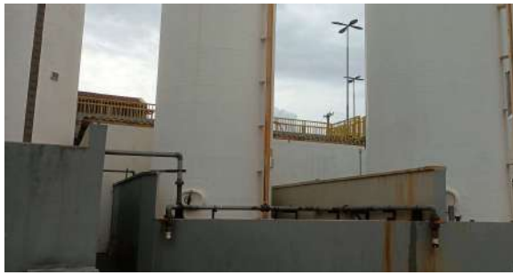
Foto 9 - Tanques de armazenamento de cloreto férrico
