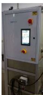
Foto 42 - Gerador de dióxido de cloro.
