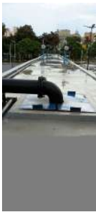
Foto 9 - Tubulação de chegada da água do Poço PTG1.
