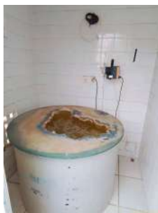
Foto 5 - Tanque de armazenamento com produto químico exposto e dosadora.
