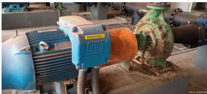
Foto 17 - Conjunto motobomba 1 Redentora.
