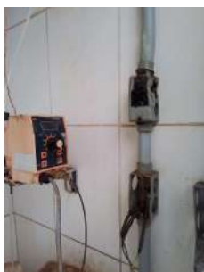
Foto 1 - Caixa de tomada danificada
