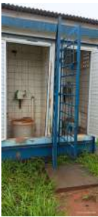
Foto 10 - Abrigo dos tanque de produtos químicos e bombas dosadoras.
