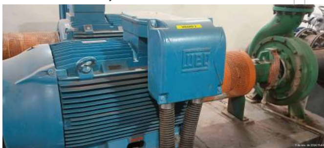
Foto 32 - Conjunto motobomba 1 Urano.
