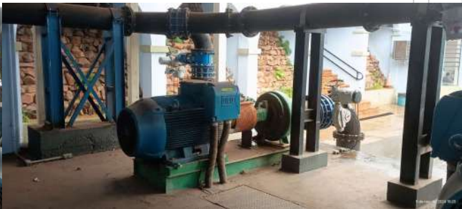
Foto 2 - Conjunto motobomba 2 Alto Alegre
