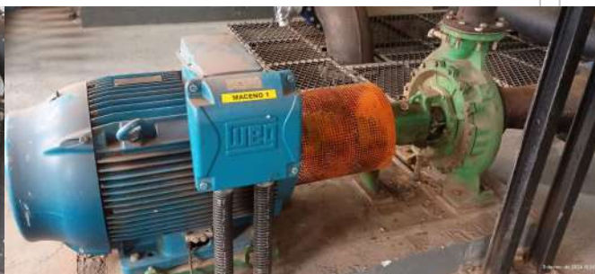
Foto 8 - Conjunto motobomba 1 Maceno.
