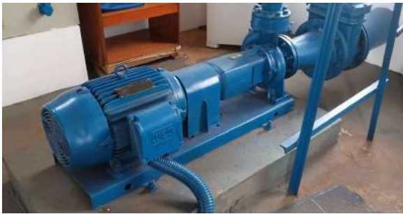
Foto 5 - Segundo conjunto motobomba da elevatória.
