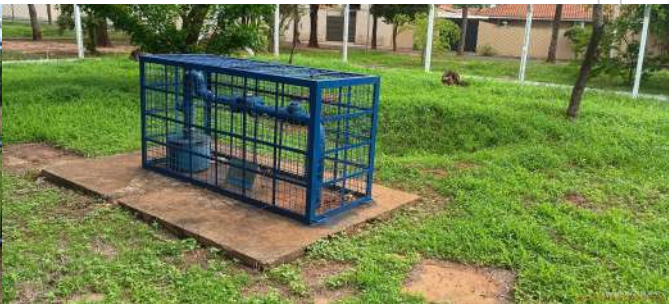
Foto 2 - Grade de proteção do poço.
