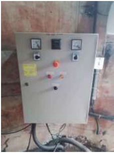
Foto 3 - Pannel elétrico do poço.
