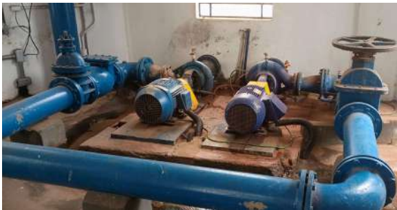
Foto 1 - Conjuntos motobomba da EEAT (1+1R).
