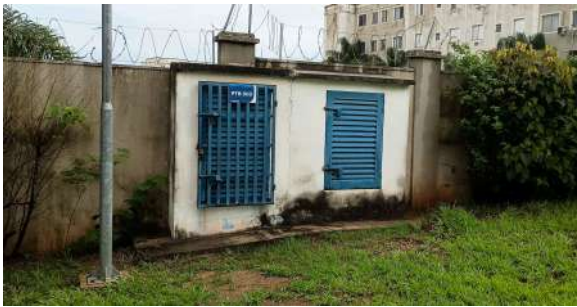
Foto 2 - Abrigo dos painéis elétricos e de comando do poço.
