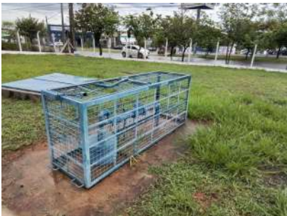
Foto 1 - Local cercado com alambrado e gaiola ao redor do cavalete do poço.
