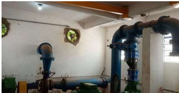
Foto 3 - Barrilete da EEAT.
