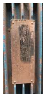
Foto 23 - Placa de especificações técnicas do motor do conjunto motobomba 1 Diniz.
