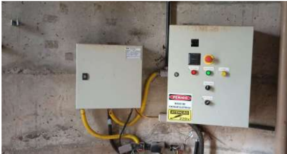
Foto 11 - Painéis elétricos e de comando.
