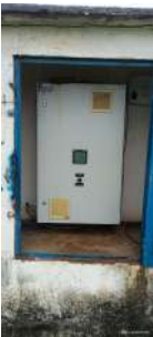
Foto 5 - Painel elétrico e de comando do poço.
