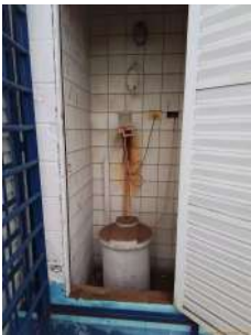
Foto 3 - Tanque de armazenamento e dosagem de hipoclorito de sódio/ácido fluorsilícico.
