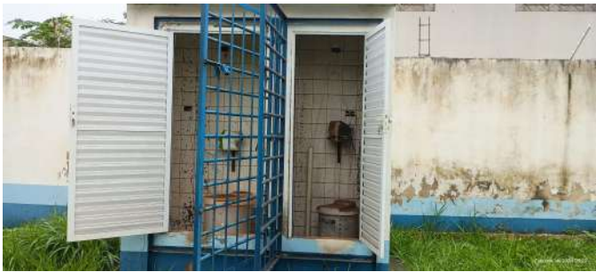
Foto 9 - Abrigo dos tanque de produtos químicos e bombas dosadoras.
