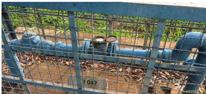
Foto 1 - Macromedidor no cavalete do poço.
