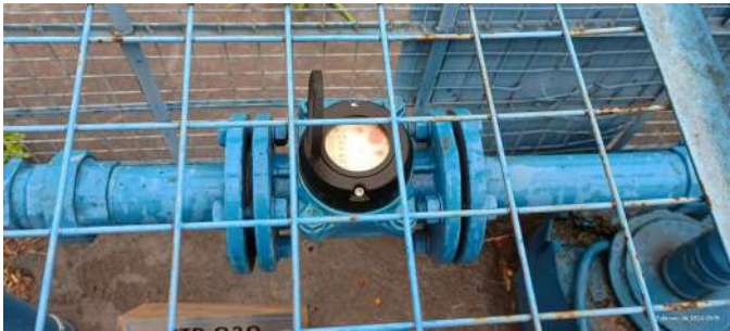
Foto 1 - Macromedidor no cavalete do Poço.
