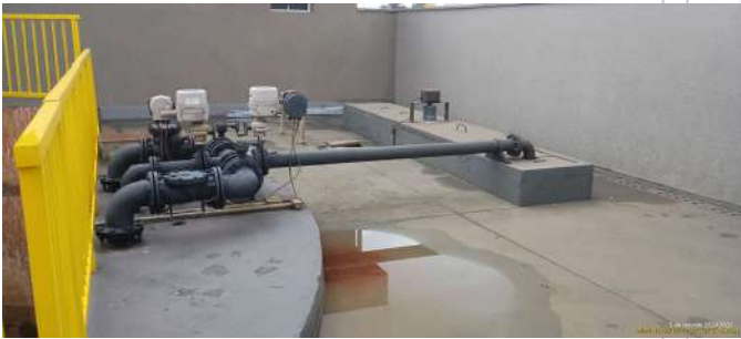
Foto 4 - Conjuntos motobomba do sistema de lodos da ETA e medidor de vazão antes do lançamento na rede de esgoto.
