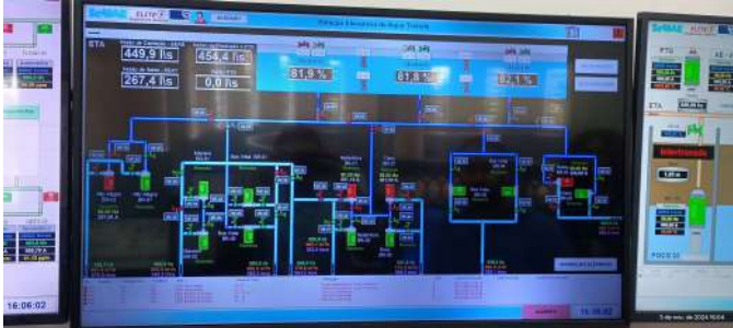
Foto 35 - Tela do sistema de controle operacional da EEAT na ETA Palácio das Águas.
