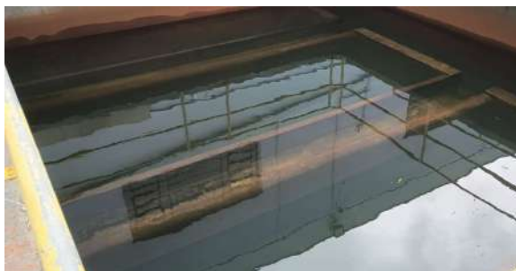
Foto 32 - Unidades de filtração.
