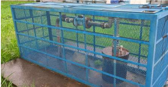
Foto 3 - Grade de proteção do poço.
