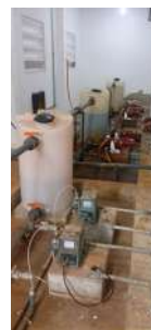
Foto 41 - Tanques e bombas dosadoras de flúor, cloreto férrico e hipoclorito. Os tanques e tubulações são independentes e não se misturam caso ocorram vazamentos.
