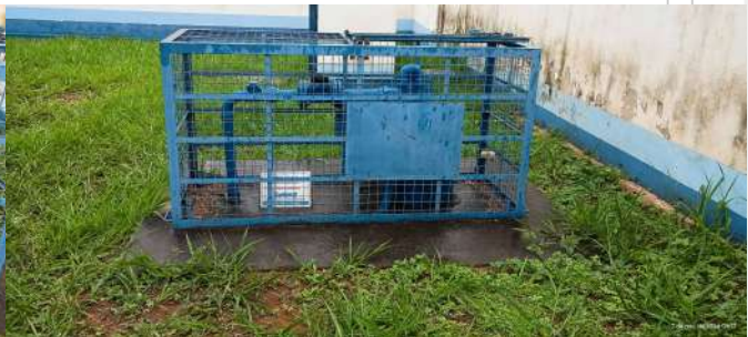
Foto 4 - Grade de proteção do poço e placa de identificação.
