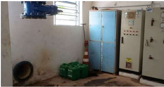
Foto 5 - Painéis elétricos e de comando da EEAT.
