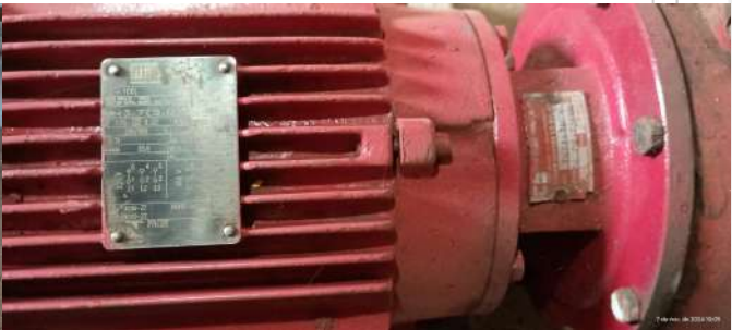
Foto 4 - Placa de especificações técnicas do conjunto motobomba 01.
