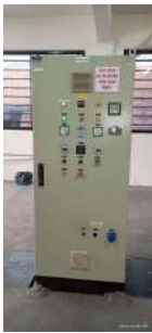
Foto 4 - Painel elétrico do Poço.
