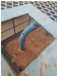
Foto 1 - Estrutura para coleta de água.
