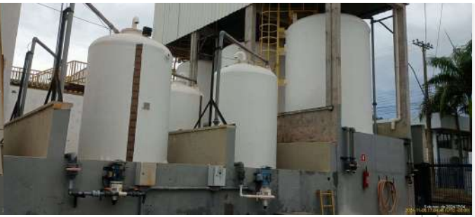
Foto 10 - Tanques de ácido sulfúrico e hipoclorito de sódio.
