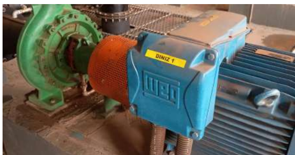
Foto 5 - Conjunto motobomba 1 Diniz.
