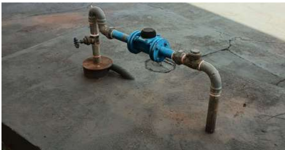
Foto 3 - Cavalete do poço.
