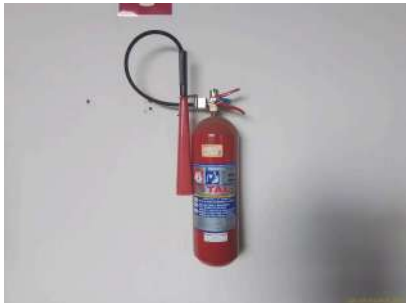
Foto 3 - Extintores de incêndio no Prédio 1.
