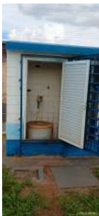
Foto 1 - Abrigo dos tanques de produtos químicos e bombas dosadoras no CR Castelinho.
