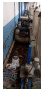
Foto 38 - Tanques e tubulações pós filtros.
