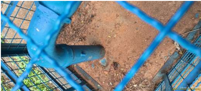
Foto 1 - Ponto de tomada de água bruta.
