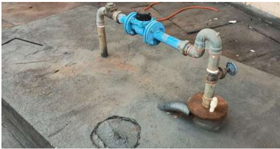
Foto 5 - Cavalete do poço.
