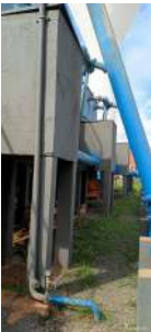
Foto 7 - Tubulação de integração da água captação do poço PTB e tubulação pós resfriamento da água do PTG 06.
