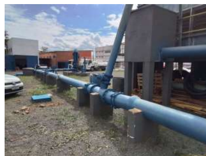
Foto 4 - Tubulação que encaminha água do poço aos resfriadores.
