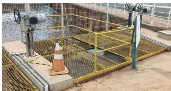
Foto 4 - Vista geral dos tanques da captação na Represa 1.
