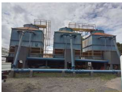
Foto 5 - Resfriadores, 3 no total.
