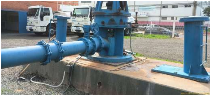
Foto 8 - Vista geral do PTG 06, com mangueira de refrigeração pela água do PTB.
