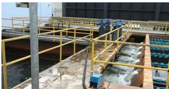
Foto 34 - Transição entre decantadores e filtros.
