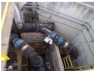
Foto 1 - Tubulações de recalque de 2 das 3 bombas da elevatória.
