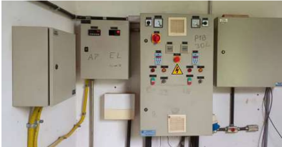
Foto 3 - Painéis elétricos e de comando da EEAT.
