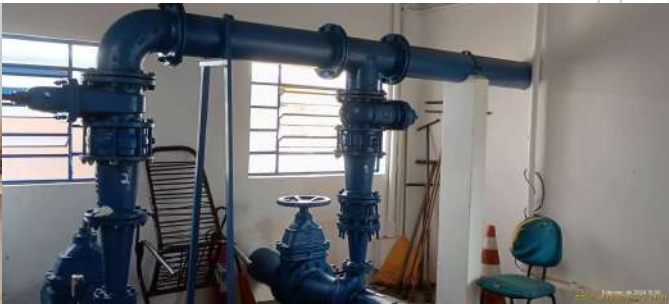
Foto 4 - Barrilete da elevatória.
