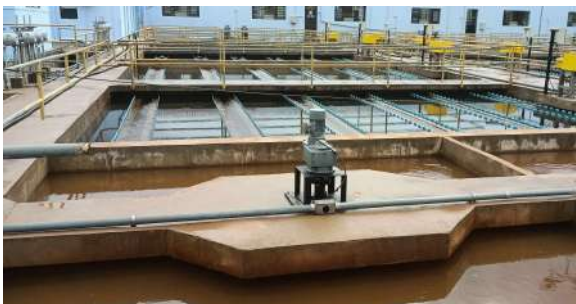
Foto 28 - Tanques de floculação e, ao fundo, decantadores.
