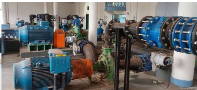
Foto 6 - Vista geral dos conjuntos motobomba internos do prédio 1.
