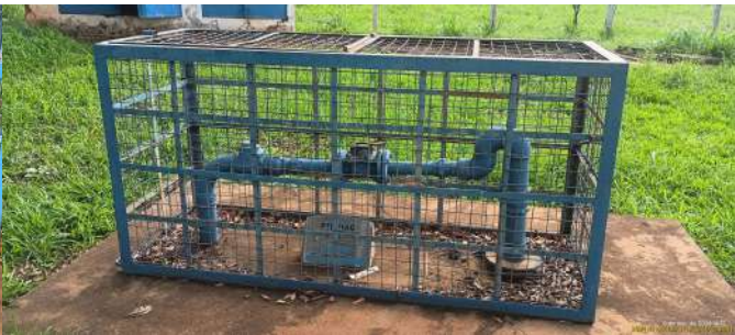
Foto 4 - Grade de proteção do poço.
