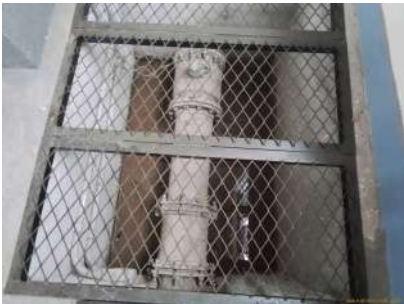
Foto 1 - Presença de água no interior de poço.
