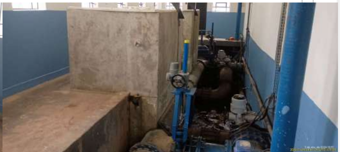
Foto 2 - Ausência de guarda-corpos.
