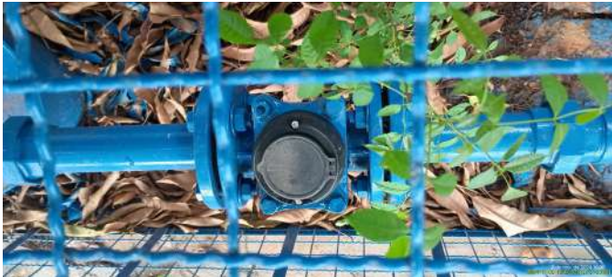
Foto 1 - Macromedidor no cavalete do poço.
