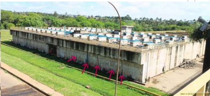
Foto 2 - Indicação dos locais com sinais de vazamentos no reator UASB 1.
