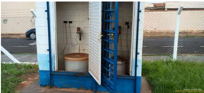
Foto 1 - Casa de química para aplicação de produtos químicos (situada no local do Reservatório Castelinho).
