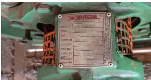
Foto 24 - Placa de especificações técnicas da bomba do conjunto motobomba 1 Diniz.
