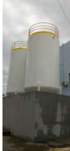
Foto 11 - Novos tanques de hidróxido de cálcio.
