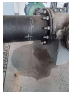
Foto 3 - Piso molhado devido ao vazamento na adutora do conjunto 1 Maceno.
