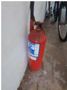
Foto 1 - Extintor de incêndio no local onde ficam os painéis de controle do poço e dos resfriadores.
