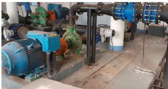
Foto 7 - Conjuntos motobomba Maceno.
