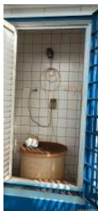
Foto 11 - Segundo tanque de produtos químicos e bomba dosadora.
