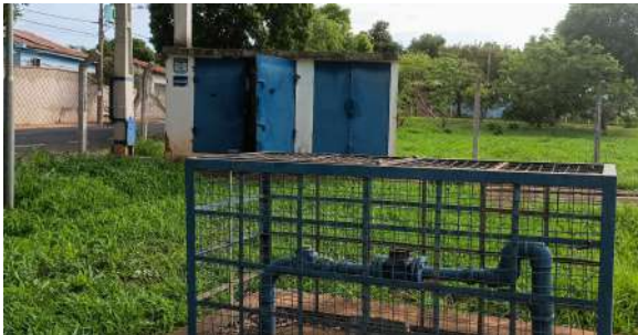
Foto 5 - Vista geral do poço e, ao fundo, abrigo dos painéis elétricos e de comando.
