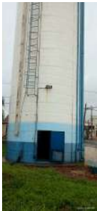
Foto 6 - Vista gera da área e da EEAT, na base do reservatório..
