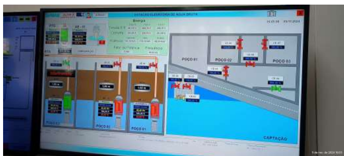
Foto 9 - Tela do sistema de controle operacional da EEAB na ETA Palácio das Águas.
