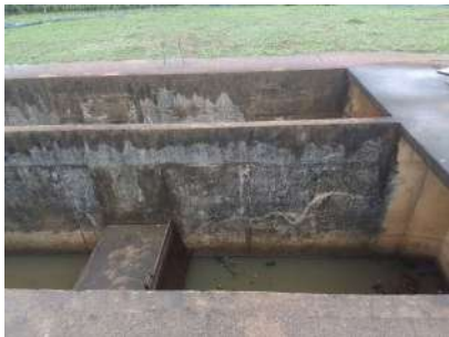
Foto 1 - Caixas de areia sem guarda-corpos ou limitadores de acesso.
