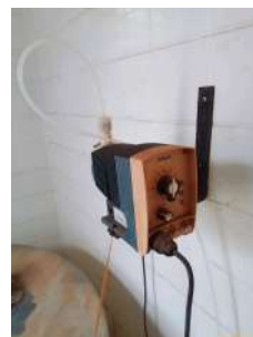
Foto 6 - Dosadora de produto químico fora de funcionamento.
