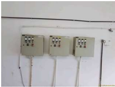
Foto 7 - Painéis de controle dos 3 resfriadores.
