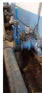
Foto 2 - Vazamento em registro na tubulação pós filtração.
