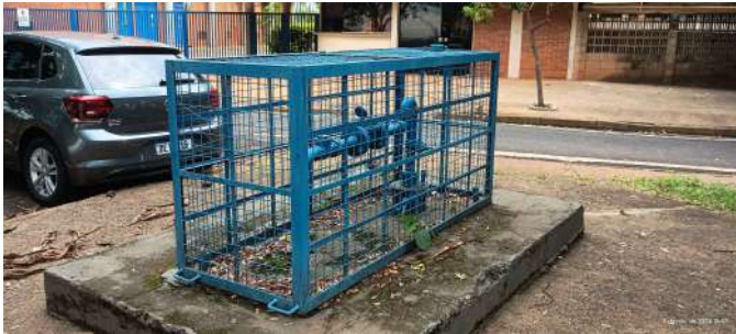
Foto 1 - Grade de proteção do poço.
