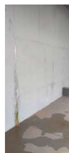
Foto 4 - Vazamentos na alvenaria do canal de água bruta (canal da calha Parshall).
