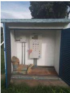
Foto 2 - Painel de controle do poço. Recomenda-se retirar os materiais estranhos à operação do poço, de modo a facilitar ações e manutenções de rotina no abrigo dos painéis elétricos.
