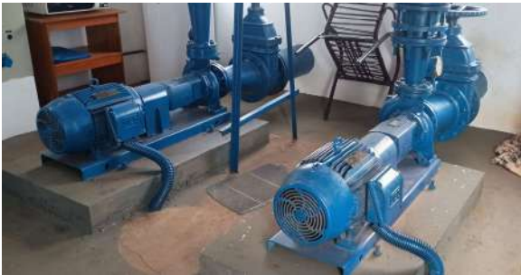
Foto 3 - Conjuntos motobomba da elevatória.
