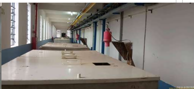
Foto 37 - Tanques pós filtros.
