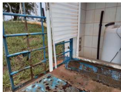
Foto 2 - Porta da casa de química quebrada.
