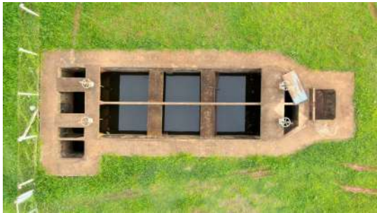
Foto 16 - Vista aérea dos canais de (da direita para esquerda) chegada de água bruta, gradeamento e desarenadores.
