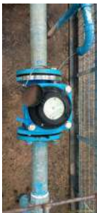
Foto 1 - Macromedidor no cavalete do Poço.
