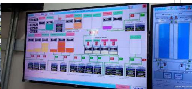
Foto 47 - Tela do sistema operacional de controle e dosagem de produtos químicos na ETA.
