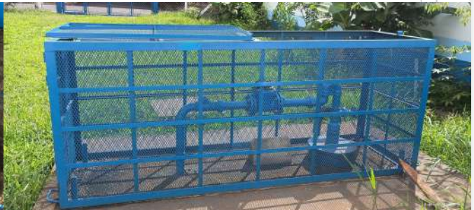
Foto 6 - Grade de proteção do poço.
