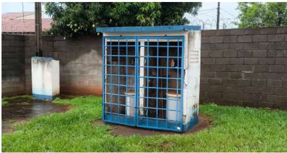
Foto 1 - Abrigo dos tanques de produtos químicos e das bombas dosadoras.
