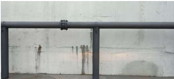
Foto 1 - Vazamento na lateral do reservatório, em frente ao Poço PTG1.
