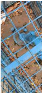
Foto 4 - Tubulação de proteção e medição de nível do poço.
