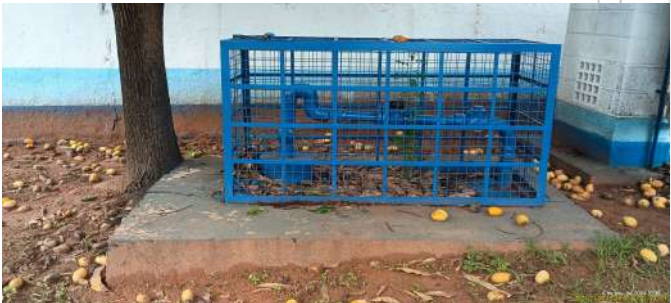
Foto 4 - Grade de proteção do poço.
