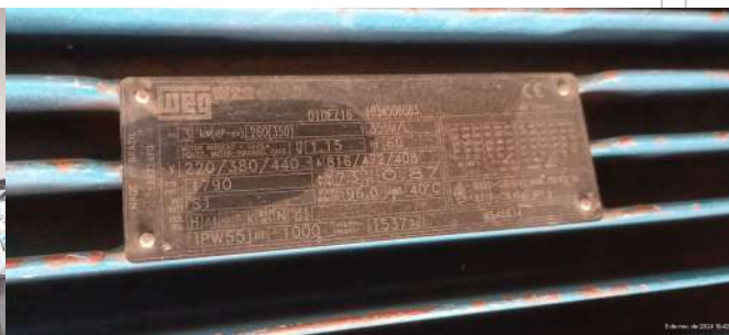
Foto 29 - Placa de especificações técnicas do motor do conjunto motobomba 3 Boa Vista.
