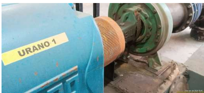
Foto 7 - Conjunto motobomba 1 Urano, com detalhe da drenagem da água de lubrificação de gaxetas.
