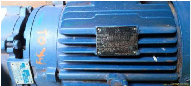
Foto 6 - Placa de especificações técnicas do motor do conjunto motobomba 01.
