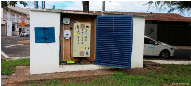
Foto 5 - PAINEL elétrico e de comando do poço.
