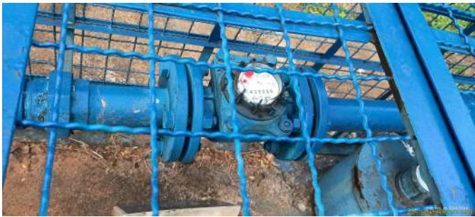
Foto 1 - Macromedidor no cavalete do poço.
