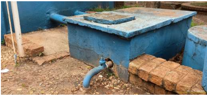
Foto 7 - Caixa de sucção da EEAT, abastecida pelo reservatório semienterrado Maceno e pelo Poço PTB 03 (ao lado).
