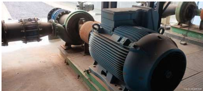
Foto 1 - Conjunto motobomba 2 Alto Alegre.
