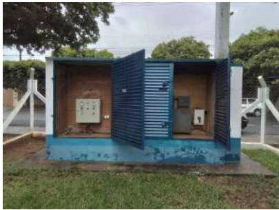
Foto 2 - Vista geral do local onde se situam os painéis elétricos e de controle do poço.
