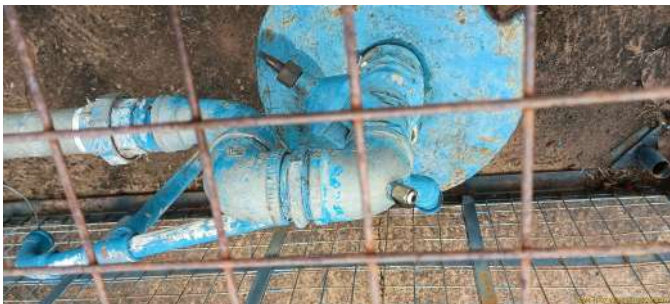
Foto 1 - Ponto de tomada de água bruta.
