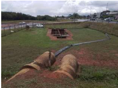
Foto 12 - Vista geral dos tanques, com mangueira da captação provisória na Represa 3, direcionando a água bruta diretamente para a adutora até a ETA Palácio das Água.
