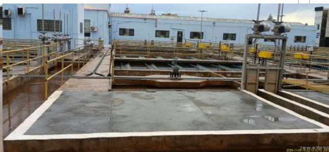
Foto 2 - Situação geral dos locais sem guarda-corpos ou com guarda-corpos inadequados.
