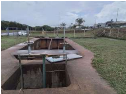
Foto 2 - Ausência de guarda-corpo em todo o perímetro dos tanques.
