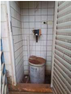
Foto 2 - Tanque de armazenamento e dosagem de Hipoclorito de Sódio ou Ácido Fluossilícico.
