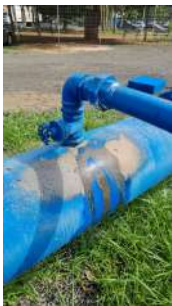
Foto 2 - Vazamento próximo à junção das tubulações.
