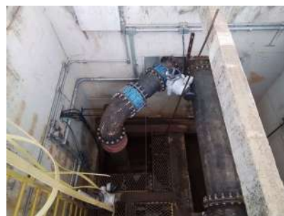
Foto 2 - Tubulação de recalque de 1 das 3 bombas da elevatória.
