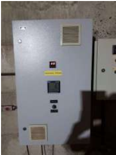
Foto 1 - Pannel de automação do poço.
