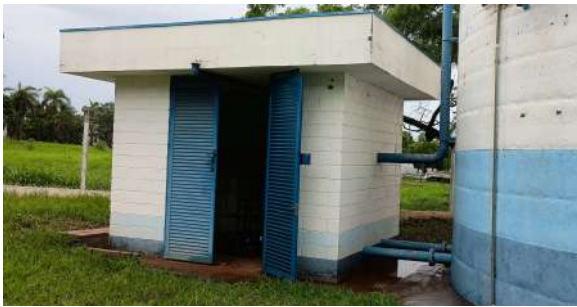
Foto 1 - EEAT ao lado do reservatório.
