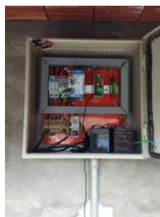
Foto 7 - Detalhe do painel elétrico no interior do abrigo.
