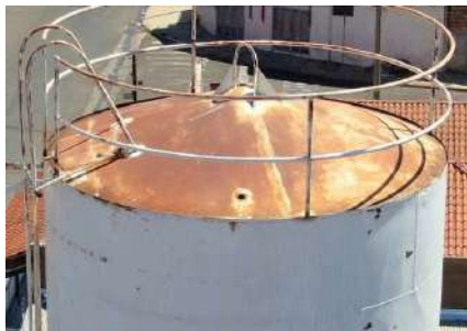
Foto 1 - Detalhe da abertura de ventilação sem proteção.
