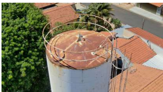
Foto 1 - Topo do reservatório sem para-raios.
