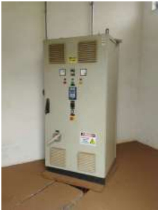
Foto 3 - Painel elétrico instalado no interior da edificação.
