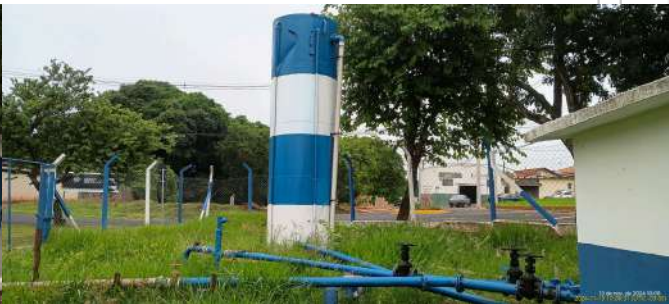
Foto 2 - Reservatório pulmão desativado.
