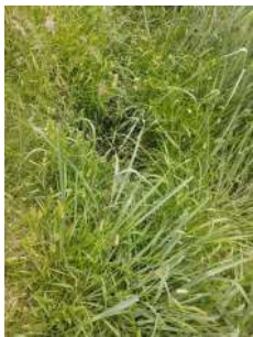
Foto 1 - Detalhe da vala coberta por vegetação.
