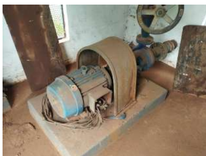
Foto 1 - Bomba instalada na elevatória, não há bomba reserva no local ou em estoque.
