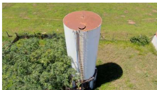
Foto 2 - Escadas e topo do reservatório sem guarda corpos.
