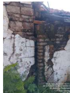
Foto 9 - Detalhe das rachaduras nas paredes.
