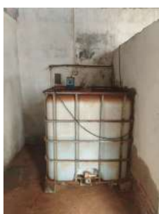
Foto 1 - Tanque e bomba dosadora de flúor localizada próxima ao Reservatório Arco Íris II.
