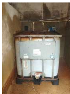
Foto 2 - Tanque e bomba dosadora de cloro.
