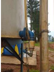
Foto 1 - Detalhe da mangueira de medição de nível.
