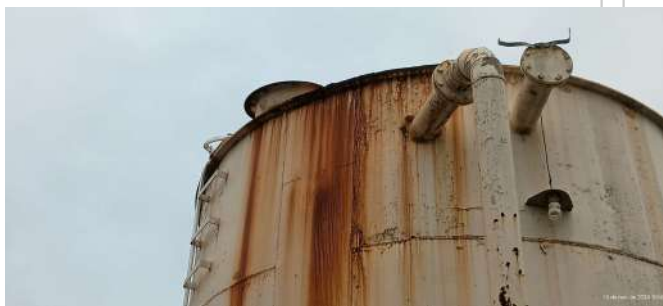
Foto 2 - Ausência de guarda corpo na escada vertical do reservatório.
