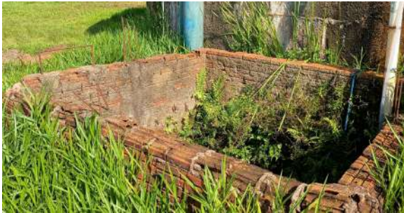
Foto 3 - Situação das pontas das ferragens na caixa de alvenaria.
