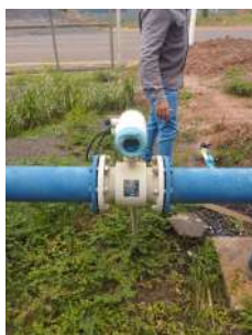
Foto 1 - Macromedidor instalado na tubulação de saída do poço.
