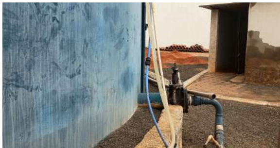
Foto 1 - Detalhe do vazamento no registro.
