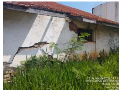
Foto 7 - Detalhe das rachaduras nas paredes.
