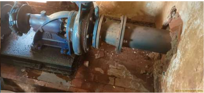
Foto 4 - Vazamento na bomba de recalque para o reservatório apoiado Filipão.
