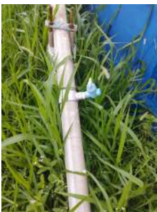
Foto 2 - Detalhe da torneira para coleta de água bruta.
