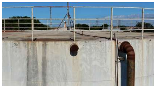
Foto 1 - Detalhe da tubulação de ventilação.
