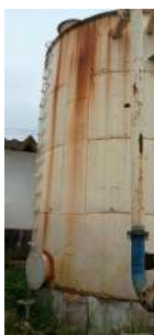
Foto 1 - Lateral do reservatório com presença de oxidação.
