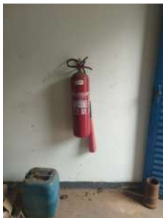
Foto 1 - Extintor de incêndio instalado no interior da edificação.
