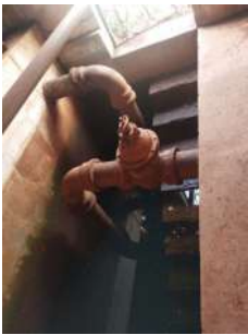
Foto 11 - Escadas e área de manobra de registros inundada por água, provavelmente proveniente de infiltrações.
