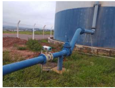
Foto 7 - Tubulação de saída da água do poço para o reservatório.
