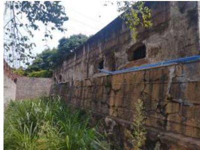
Foto 7 - Parede dos fundos do reservatório, com detalhe das mangueiras de aplicação de cloro e flúor na água do reservatório.
