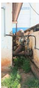
Foto 17 - Tubulações de alimentação das motobombas (vindas do reservatório enterrado)
