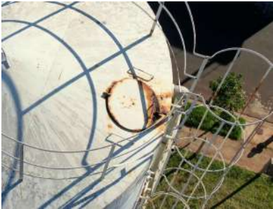
Foto 1 - Detalhe da tampa de inspeção deteriorada. Há uma abertura próxima a alça.
