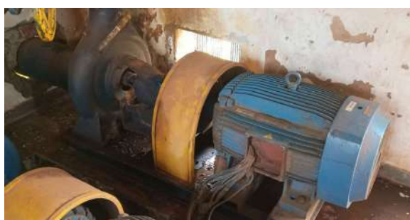
Foto 1 - Drenagem inadequada do conjunto motobomba 1 (próximo à entrada da EEAT).
