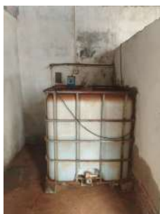
Foto 1 - Tanque e bomba dosadora de flúor.
