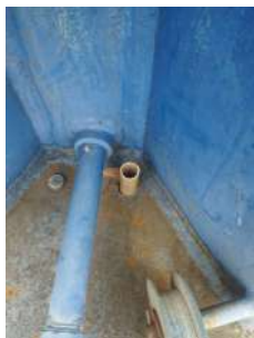
Foto 1 - Detalhe do tubo de medição de nível.
