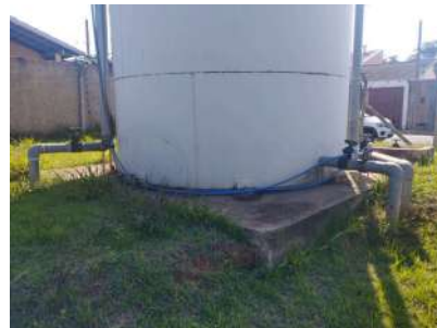
Foto 4 - Tubulações de entrada e saída de água tratada.
