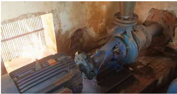
Foto 3 - Vazamento na bomba de recalque para o reservatório apoiado Filipão.
