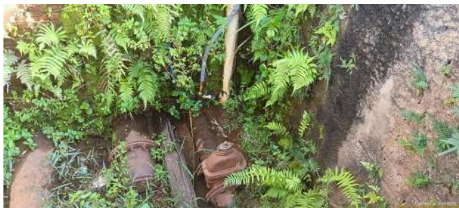
Foto 1 - Medidor do sistema de telemetria.
