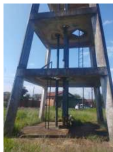
Foto 6 - Tubulações de entrada e saída de água tratada.
