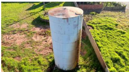
Foto 3 - Pontos com água jorrando através dos orifícios da parede do reservatório.
