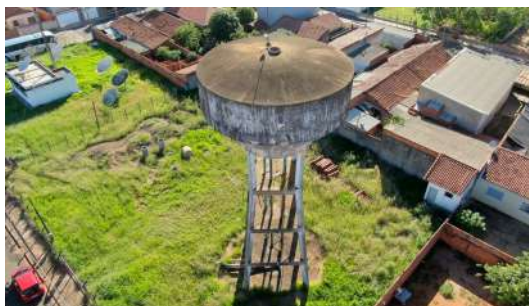
Foto 2 - Topo do reservatório sem proteção.
