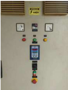
Foto 4 - Detalhe dos comandos do painel elétrico.
