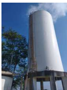
Foto 1 - Escada do reservatório sem guarda corpos.
