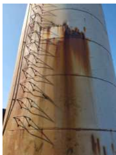
Foto 1 - Ponto com vazamentos.
