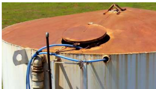
Foto 2 - Detalhe da mangueira inserida na abertura da tampa. Nesta imagem é possível visualizar a degradação da base da tampa de inspeção.
