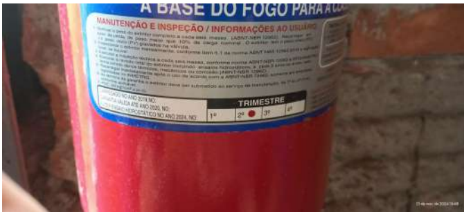
Foto 1 - Detalhe da etiqueta de controle de manutenções do extintor - fora da validade.
