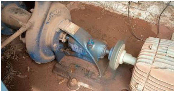
Foto 1 - Ausência de drenagem adequada.
