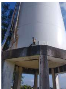
Foto 1 - Detalhe do equipamento de telemetria instalado na base do reservatório.
