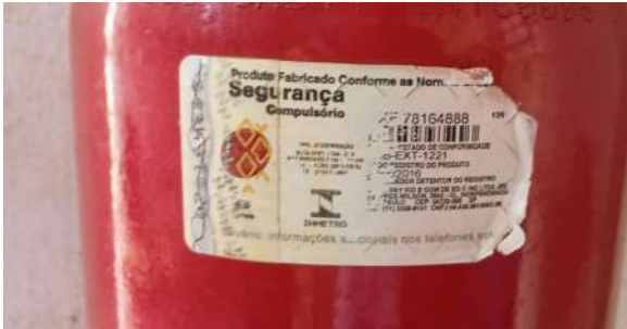
Foto 1 - Selo de fabricação do extintor.
