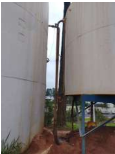
Foto 4 - Tubulação de chegada da água no reservatório.
