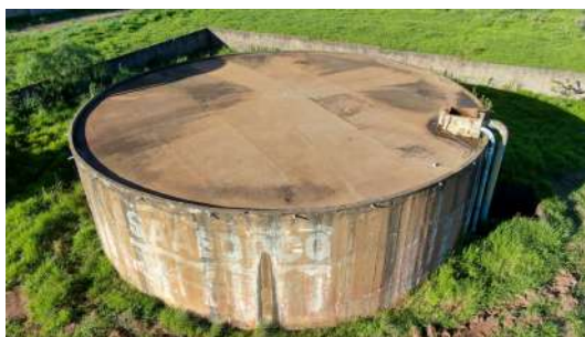
Foto 2 - Ausência de guarda-corpos no topo do reservatório.
