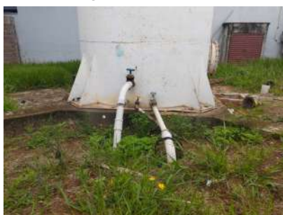
Foto 5 - Tubulações de saída da água para a rede de distribuição.
