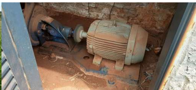
Foto 4 - Conjunto motobomba em operação na EEAT.
