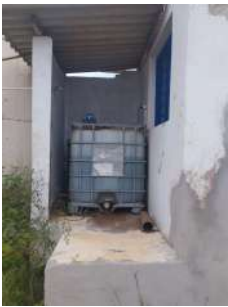
Foto 1 - Tanque e bomba dosadora de flúor.
