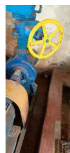
Foto 2 - Detalhe do vazamento no registro.
