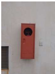
Foto 1 - Abrigo do extintor de incêndio instalado na parede externa da edificação de apoio.
