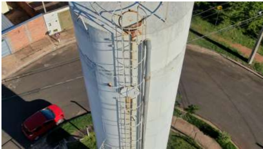
Foto 1 - Detalhe do tubo extravasor ao lado da escada.
