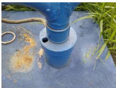
Foto 1 - Detalhe do tubo medidor de nível.
