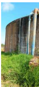
Foto 1 - Ausência de guarda-corpo.
