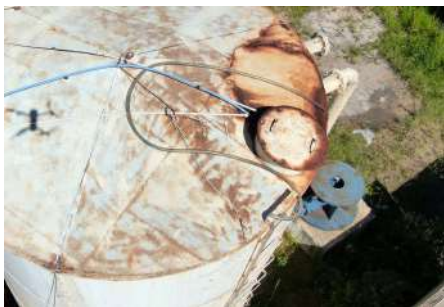
Foto 1 - Tampa de inspeção com oxidação e processos corrosivos.
