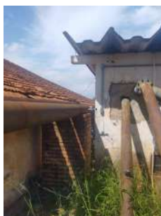
Foto 1 - Detalhe do equipamento de telemetria instalado na tubulação que sai do reservatório.
