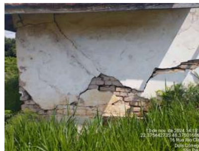
Foto 6 - Detalhe das rachaduras nas paredes.
