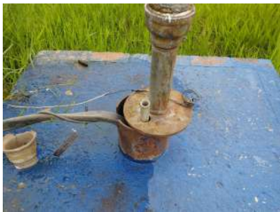
Foto 1 - Detalhe do tubo de medição de nível.
