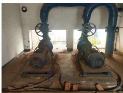
Foto 1 - Bombas instaladas na elevatória.
