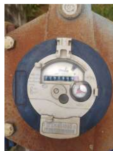
Foto 2 - Detalhe do macromedidor.
