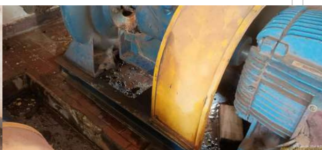
Foto 2 - Detalhe do piso molhado próximo ao conjunto motobomba 1.
