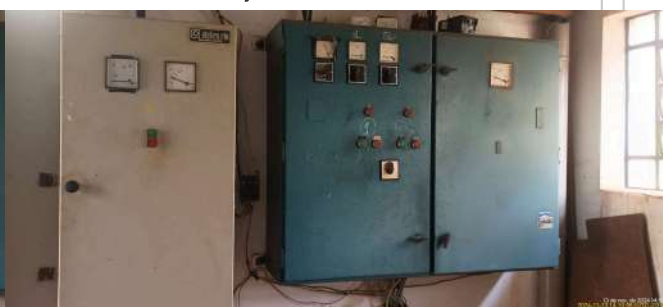
Foto 16 - Painéis elétricos e de comando da EEAT.
