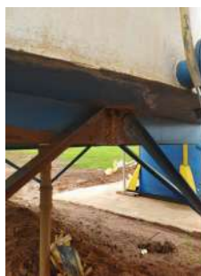
Foto 2 - Detalhe do ponto com vazamento no reservatório.
