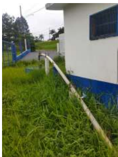
Foto 1 - Tubulação onde está instalada a torneira para coleta de água bruta.
