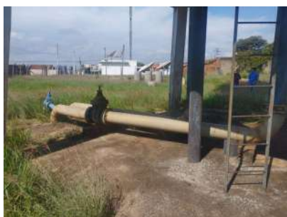
Foto 7 - Detalhe da tubulação de distribuição de água tratada.
