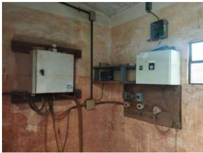
Foto 4 - Painéis elétricos no interior da edificação.
