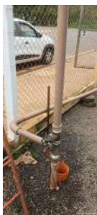
Foto 3 - Detalhe do vazamento na tubulação de derivação para teste da rede de abastecimento do novo loteamento próximo.
