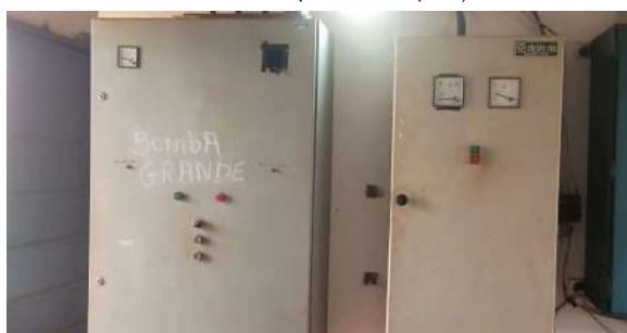
Foto 15 - Painéis elétricos e de comando da EEAT.
