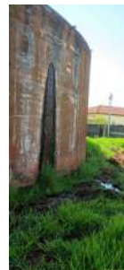
Foto 2 - Vazamento na lateral do reservatório.
