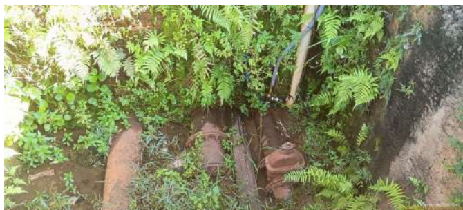
Foto 5 - Vazamentos em tubulações e registros na caixa lateral.
