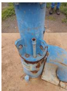
Foto 1 - Detalhe do tubo de medição de nível.
