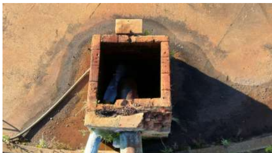
Foto 1 - Detalhe da abertura de inspeção sem tampa.
