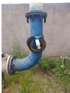
Foto 1 - Detalhe da torneira para coleta de água bruta.
