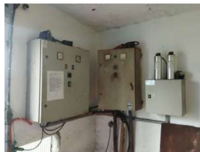
Foto 4 - Painéis elétricos no interior da edificação.
