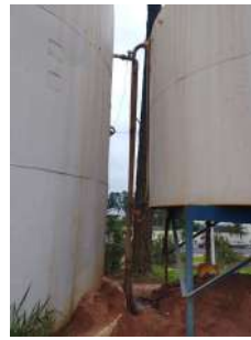
Foto 4 - Tubulação de chegada da água no reservatório.
