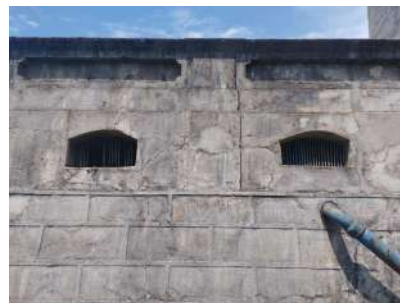
Foto 2 - Aberturas do reservatório sem tela de proteção.
