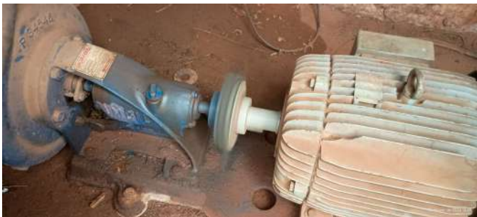
Foto 1 - Ausência de proteção para evitar contato com o eixo em rotação.
