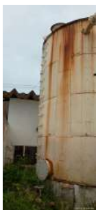
Foto 1 - Ausência de guarda corpo na escada vertical do reservatório.
