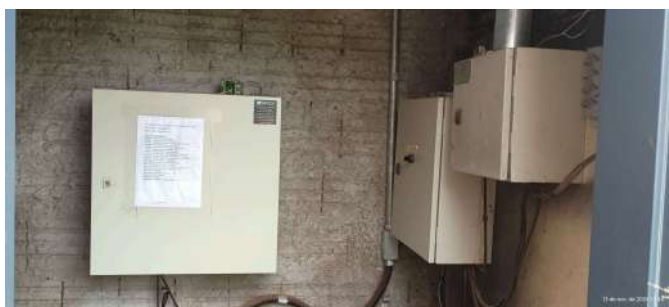
Foto 5 - Painéis elétricos e de comando da EEAT.
