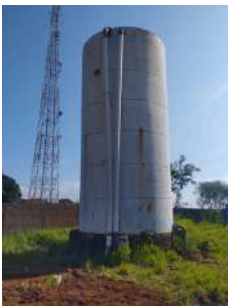
Foto 1 - Segundo o prestador, o tubo da direita é o extravasor e está conectado ao reservatório de concreto.
