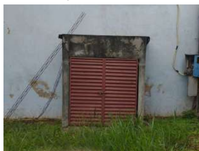
Foto 6 - Abrigo do painel elétrico.
