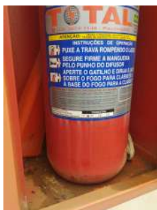
Foto 1 - Detalhe da etiqueta de controle de manutenções do extintor - fora da validade.
