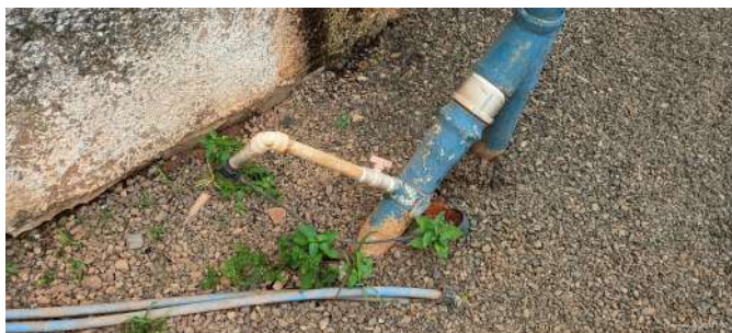
Foto 1 - Detalhe do equipamento de telemetria.
