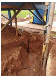
Foto 1 - Ponto com vazamento no reservatório.
