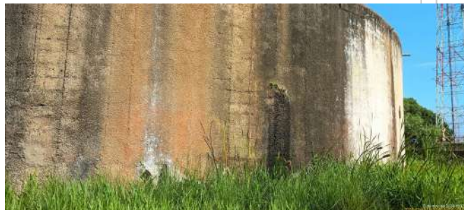
Foto 4 - Vazamento na lateral do reservatório.
