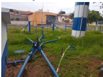
Foto 5 - Tubulação de entrada da água do poço para a elevatória.
