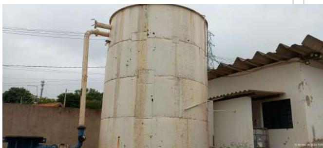
Foto 2 - Lateral do reservatório com presença de oxidação.
