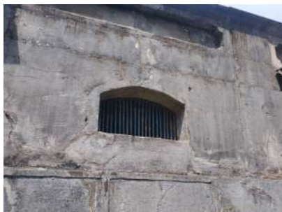
Foto 1 - Aberturas do reservatório sem tela de proteção.
