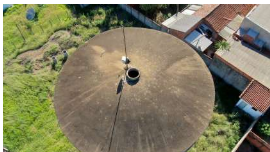
Foto 1 - Haste de para-raios no topo do reservatório.
