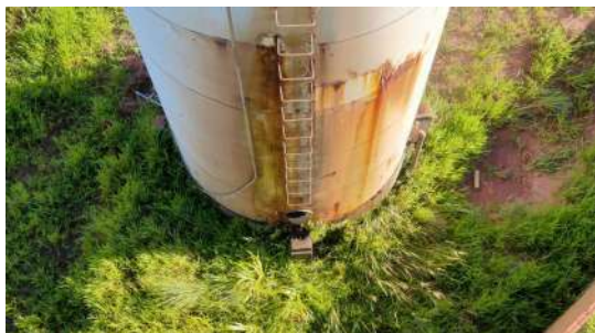
Foto 5 - Diversos pontos com vazamento próximos aos degraus da escada.
