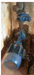
Foto 13 - Conjunto motobomba 4 (abastece o reservatório apoiado Filipão).
