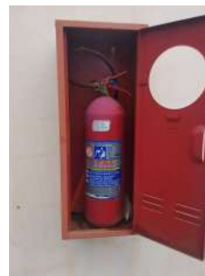
Foto 2 - Detalhe do extintor de incêndio.
