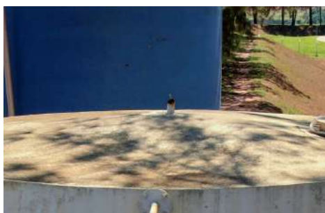
Foto 1 - Detalhe do tubo de ventilação sem tela de proteção.
