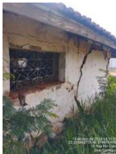
Foto 8 - Detalhe das rachaduras nas paredes.
