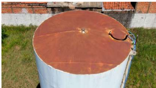
Foto 1 - Ausência de para-raios no topo do reservatório.
