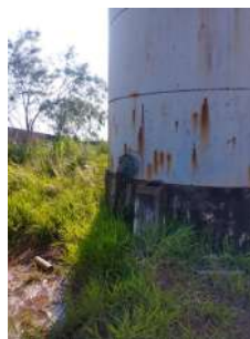
Foto 2 - Água do vazamento escoando sobre o solo.
