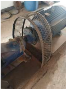
Foto 2 - Detalhe da gaxeta da bomba 2.
