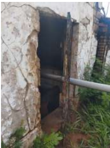
Foto 12 - Porta do reservatório que se encontrava aberta no momento da fiscalização.
