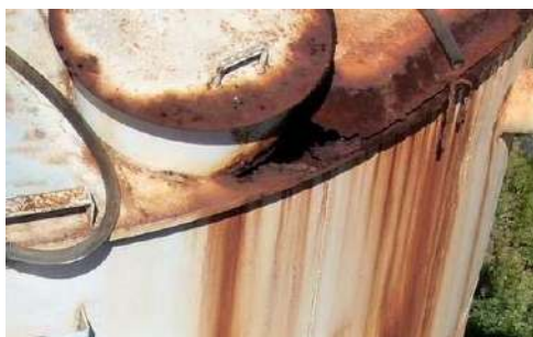
Foto 3 - Detalhe da abertura no topo do reservatório, causada pelo processo corrosivo.
