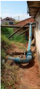
Foto 19 - Tubulações de recalque da EEAT.
