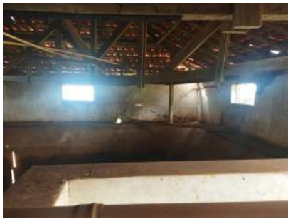
Foto 10 - Vista interna das rachaduras na parede.
