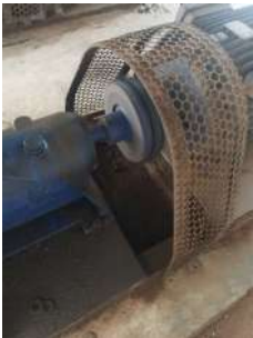
Foto 1 - Detalhe da gaxeta da bomba 1.
