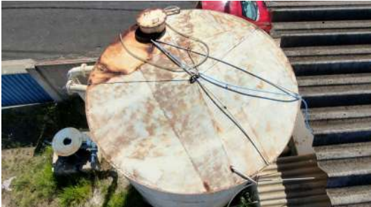
Foto 3 - Detalhe das mangueiras de aplicação de cloro e fluor no topo do reservatório.
