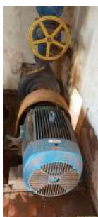
Foto 7 - Conjunto motobomba 1 (próximo à entrada).
