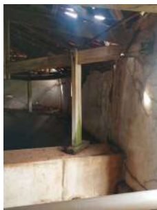
Foto 5 - Detalhe de improviso na sustentação do madeiramento do telhado.
