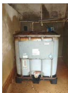
Foto 2 - Tanque e bomba dosadora de cloro localizada próxima ao Reservatório Arco Íris II.
