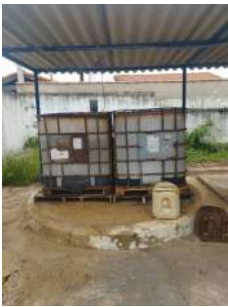
Foto 2 - Tanques e bomba dosadora de cloro.
