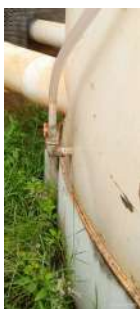
Foto 1 - Vazamento na saída para a mangueira de medição de nível.
