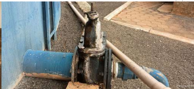
Foto 2 - Detalhe do vazamento no registro.
