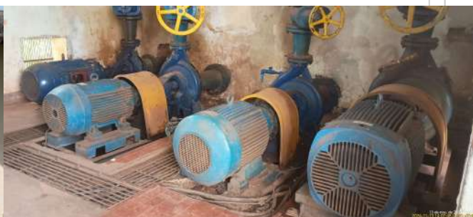
Foto 5 - Conjuntos motobomba da EEAT.
