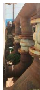
Foto 18 - Tubulações de alimentação das motobombas (vindas do reservatório enterrado)
