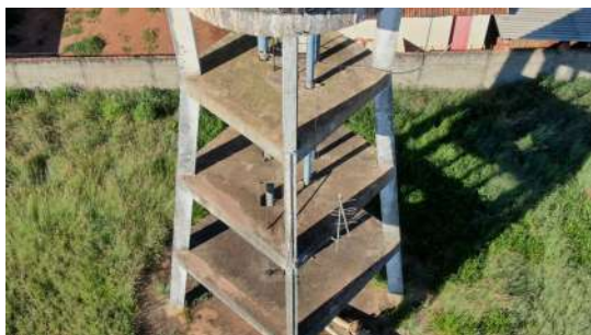
Foto 1 - Plataformas sem proteção.
