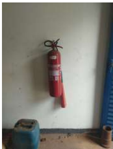
Foto 1 - Extintor instalado no interior da edificação.
