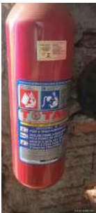
Foto 1 - Extintor de incêndio instalado no interior da edificação.
