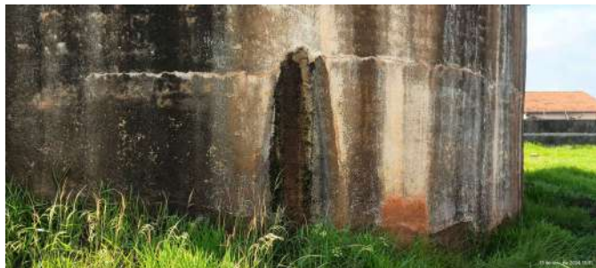
Foto 1 - Vazamento na lateral do reservatório.
