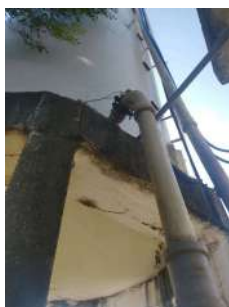
Foto 1 - Ponto com vazamento na tubulação.
