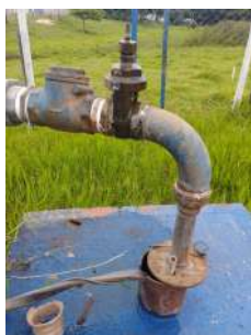
Foto 1 - Detalhe do ponto da tubulação com vazamento.
