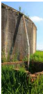
Foto 3 - Vazamento na lateral do reservatório.
