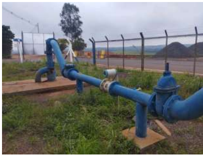
Foto 6 - Tubulação de saída da água do poço para o reservatório.
