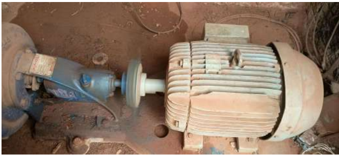
Foto 1 - Detalhe do único conjunto moto bomba da elevatória.
