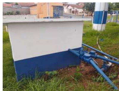
Foto 6 - Tubulação de recalque da elevatória.
