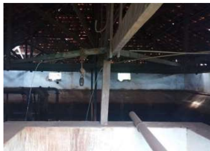
Foto 8 - Detalhe das mangueiras de aplicação de cloro e flúor diretamente no reservatório.
