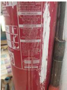
Foto 1 - Detalhe da etiqueta de manutenções do extintor - fora da validade.
