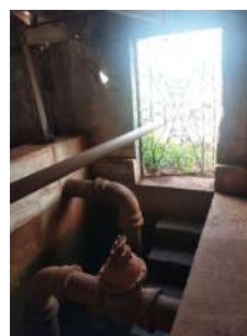
Foto 4 - Porta do reservatório sem qualquer tipo de proteção.
