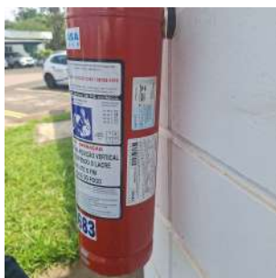
Foto 3 - Extintores junto aos painéis de controle dos aeradores
