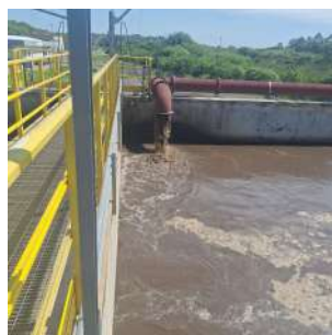
Foto 12 - Etapa de entrada de esgoto após preliminar
