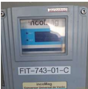
Foto 3 - Macromedição - vazão de entrada
