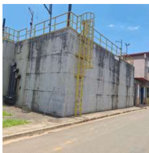
Foto 2 - Tanque de lodo da ete
