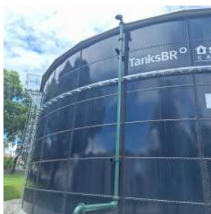
Foto 1 - Ventilação da tubulação - Reservatório Apoiado B - Norte Sul
