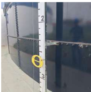
Foto 1 - Medidor de nível mecânico - Reservatório semienterrado B
