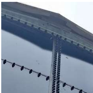
Foto 1 - Tela de proteção sob a cobertura do Reservatório apoiado B - Nova Europa
