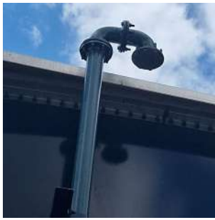
Foto 1 - Tela de proteção na tubulação de ventilação
