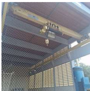
Foto 3 - Sistema para içamento dos conjunto motobomba para manutenção
