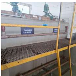
Foto 18 - Tanques de preparo de polímero para desidratação do lodo
