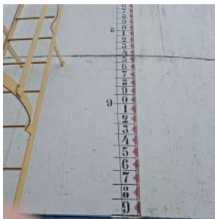
Foto 1 - Medidor de nível mecânico - Reservatório Swiss Park Apoiado
