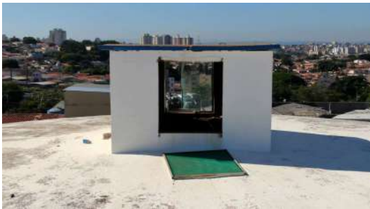
Foto 1 - Ausência de tela de proteção - Res Eulina Semienterrado Circular B
