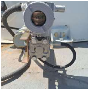
Foto 1 - Medidor de nível - Reservatório Apoiado Artesano
