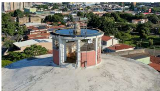
Foto 1 - Porta aberta e vidros quebrados - cobertura - Res Nova Aparecida Elevado
