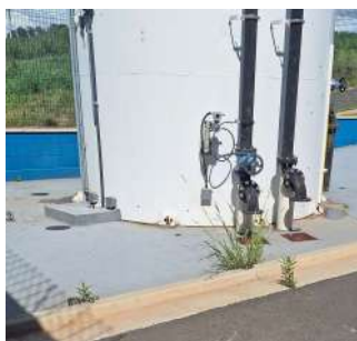
Foto 1 - Extravasor - Reservatório Artesano
