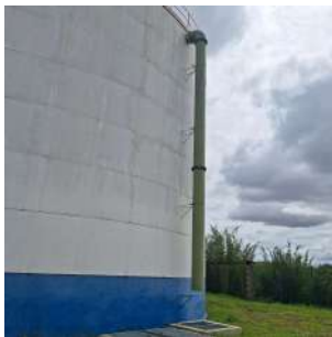
Foto 1 - Tubo extravasor - Reservatório Swiss Park Apoiado
