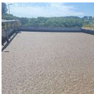
Foto 11 - Etapa - tratamento biológico - aeróbio
