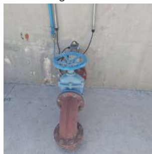
Foto 7 - Válvula descarte de lodo
