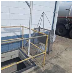
Foto 3 - Cesto de retenção de sólidos da EEE da ETE
