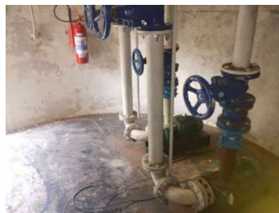
Foto 5 - Reservatório retirado e livre passagem para extintor. Fonte: SANASA
