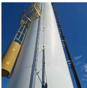
Foto 1 - Cabo de descida do para-raios - Reservatório Artesano Elevado
