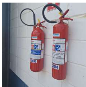
Foto 2 - extintores na estação elevatória
