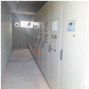
Foto 10 - Painel de controle dos aeradores
