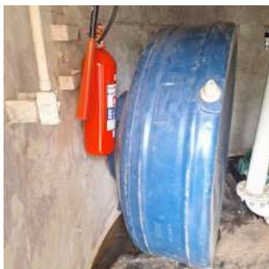
Foto 3 - Reservatório obstruindo acesso à extintor de incêndio
