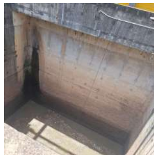
Foto 4 - Poço de sucção - Elevatória da ETE Anhumas
