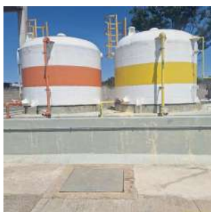
Foto 1 - Tanques de ácido cítrico e de hipoclorito.
