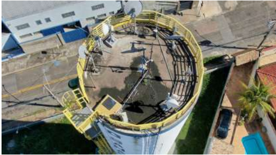
Foto 1 - Tampa de inspeção e para-raios - Res Eulina Elevado
