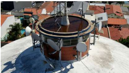
Foto 1 - Água parada na cobertura - Res Nova Europa Elevado
