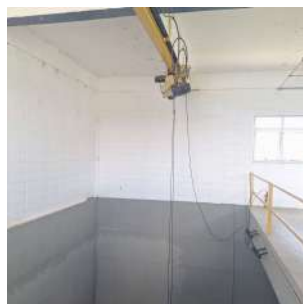
Foto 2 - Sistema para içamento dos conjuntos para manutenção
