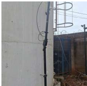
Foto 1 - Cabo de descida do para-raios não aterrado.
