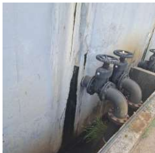
Foto 1 - Marcas de vazamento - reator UASB
