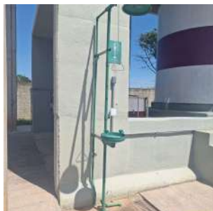
Foto 1 - Ponto com chuveiro de emergência
