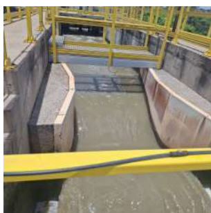
Foto 1 - Macromedição na entrada
