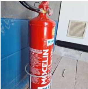
Foto 1 - Extintor novo - carga até 2026
