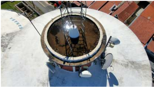
Foto 1 - Água parada na cobertura - Res São Bernardo Elevado
