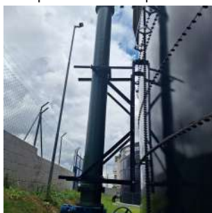
Foto 5 - Tubulação de entrada da água - Reservatório Apoiado B - Norte Sul
