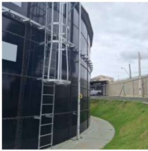
Foto 1 - Medidor de nível mecânico - Reservatório apoiado B - Nova Europa
