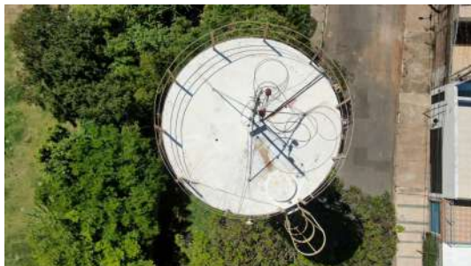
Foto 2 - Para-raios - Reservatório elevado Vila Georgina Cohab
