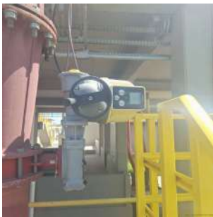
Foto 1 - Macromedição na entrada
