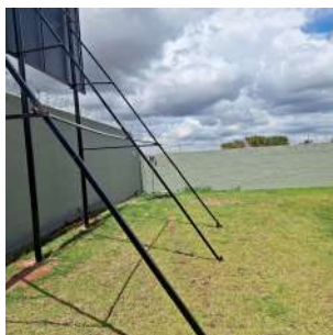
Foto 1 - Cercamento por muro e arame farpado - Reservatório Semienterrado C - DIC V
