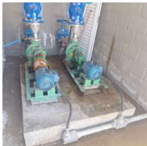
Foto 1 - Vazamento nas gaxetas no recalque de água de reúso
