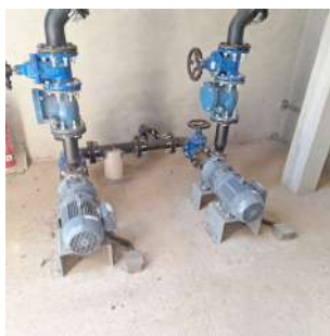
Foto 1 - Dois conjuntos motobomba instalados - EEA Artesano
