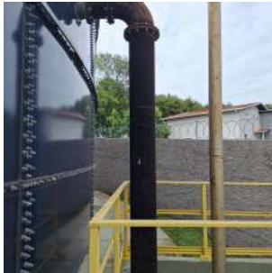
Foto 1 - Tubo Extravasor - Reservatório Apoiado B - São Vicente
