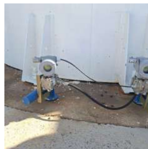
Foto 2 - Medidor de nível - duas câmaras
