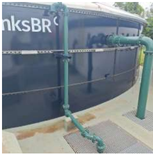
Foto 1 - Admissão de ar para tubulação - Reservatório semienterrado B
