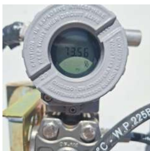
Foto 1 - Medidor de nível digital - Reservatório Artesano Elevado
