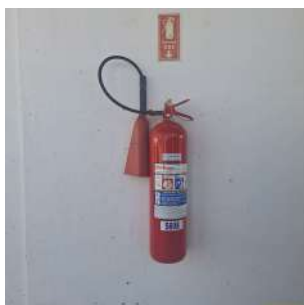
Foto 1 - Extintor no sistema de medição da entrada de esgoto.
