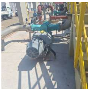
Foto 8 - Bomba de inversão da rotação - sistema de filtração por membranas
