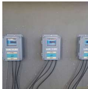
Foto 2 - Leitores - macromedição - entrada do esgoto
