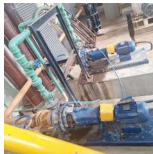
Foto 17 - Água do tratado para serviços da ETE
