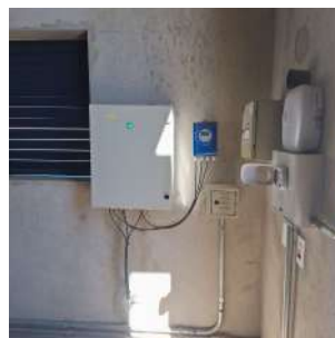
Foto 2 - Painel com medidor na EEA Artesano
