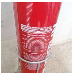
Foto 1 - Extintor de incêndio novo - validade de carga até 2026
