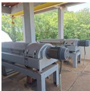
Foto 1 - Centrifugas para desidratação do lodo
