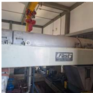
Foto 1 - Centrífuga para desidratação do lodo
