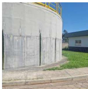
Foto 2 - Manchas de vazamento - tanque de água de reúso (2)
