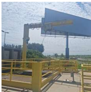
Foto 1 - Trave e guincho para içamento das bombas
