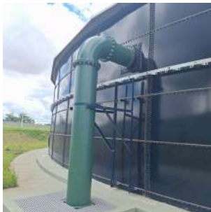
Foto 1 - Extravasor - Reservatório semienterrado B
