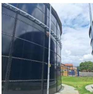
Foto 1 - Medidor de nível mecânico - Reservatório Apoiado B - Norte Sul
