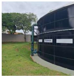
Foto 2 - Tubulação de entrada - Reservatório apoiado B - Nova Europa
