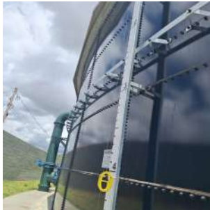
Foto 1 - Medidor de nível mecânico - Reservatório semienterrado B
