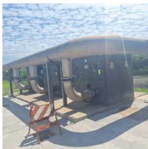
Foto 13 - Sopradores para tanque de aeração
