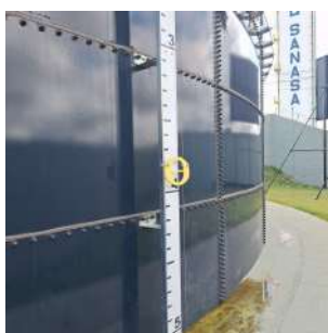
Foto 1 - Medidor de nível mecânico - Reservatório Semienterrado C - DIC V
