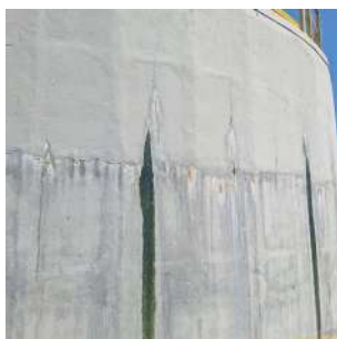
Foto 1 - Manchas de vazamento - tanque de água de reúso.
