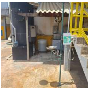
Foto 1 - Chuveiro de emergência em funcionamento
