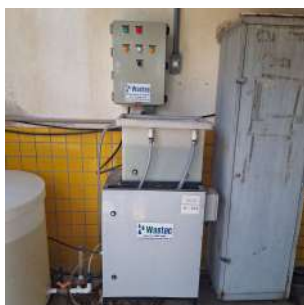
Foto 15 - Sistema de neutralização de odores
