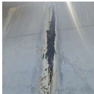
Foto 2 - Marcas de vazamento - reator UASB (2)
