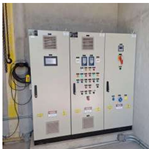
Foto 3 - Painel elétrico e de comando - conjuntos motobomba da EEA Artesano
