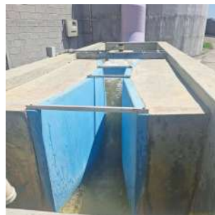
Foto 4 - Saída do tratamento com sensor de nível e macromedição de vazão.
