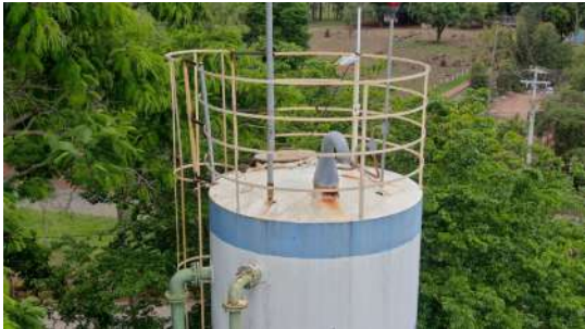
Foto 1 - Tampa de inspeção e ventilação - Res Village Campinas Elevado
