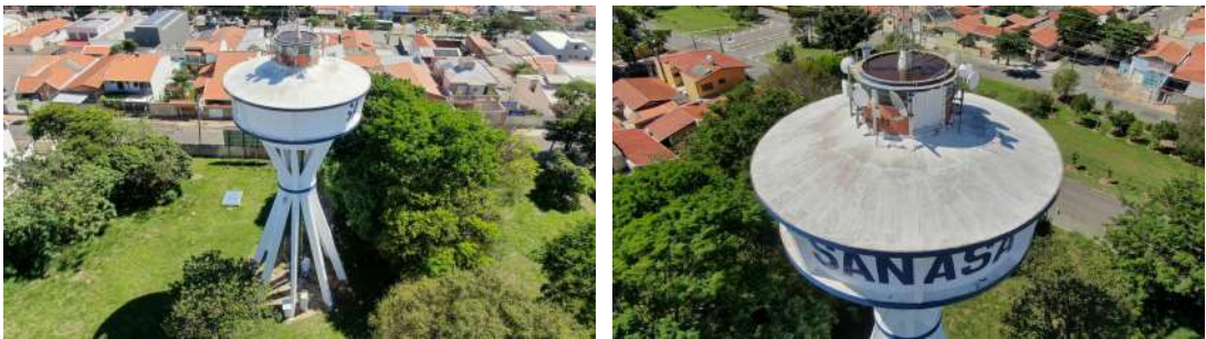
Foto 1 - Visão geral - Res Nova Europa Elevado Foto 2 - Cobertura - Res Nova Europa Elevado
