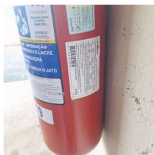
Foto 2 - Extintor de incêndio com validade regular
