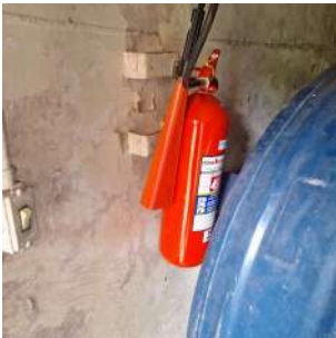
Foto 2 - Extintor de incêndio - Elevatória sob o reservatório elevado
