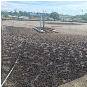
Foto 12 - Digestor do lodo
