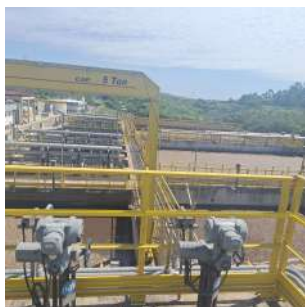
Foto 6 - Visão de cima: etapas do tratamento - ETE Boa Vista
