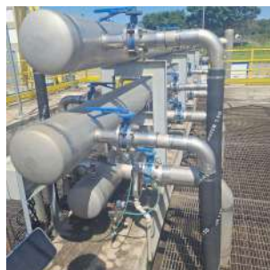
Foto 10 - Tubulações de ar e de permeado
