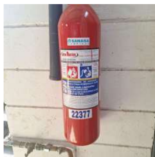
Foto 4 - Extintor- área de recirculação do lodo
