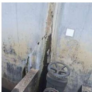
Foto 3 - Marcas de vazamento - reator UASB (3)
