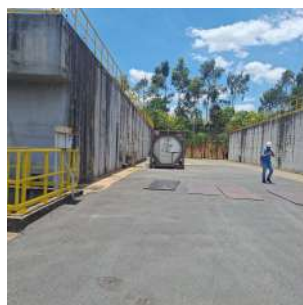
Foto 16 - Tanque de peróxido de hidrogênio _ oxidação do sulfato para controle de odores
