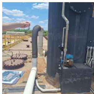
Foto 18 - Sistema lavador de gás
