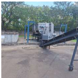
Foto 3 - Esteira - retirada de sólidos gradeamento
