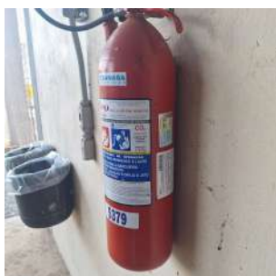
Foto 1 - Extintor de incêndio na área da estação elevatória
