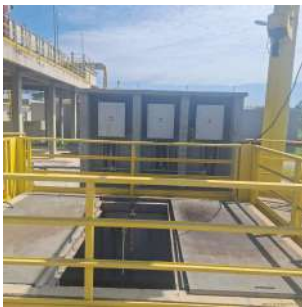
Foto 1 - 3 conjuntos motobomba instalados (painéis)
