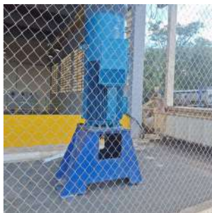
Foto 1 - Motor retirado para manutenção
