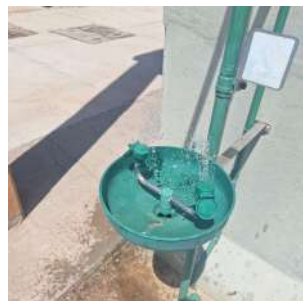
Foto 2 - Lavador de olhos funcionando
