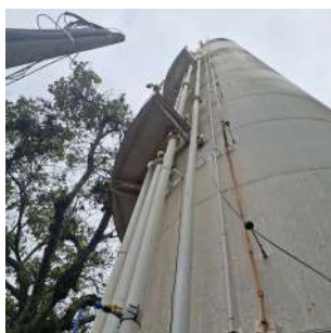
Foto 1 - Tubulações do Reservatório elevado - Vila Georgina - COHAB
