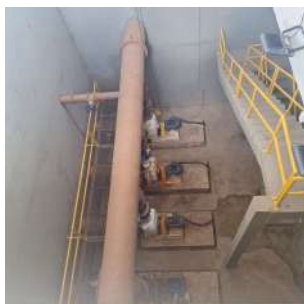
Foto 1 - Acesso para os conjunto motobomba instalados
