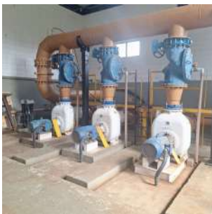
Foto 16 - Bombas de recirculação do lodo _ a partir do decantador
