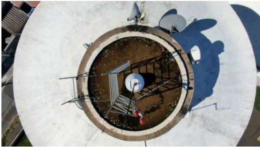
Foto 1 - Para-raios - Res São Bernardo Elevado
