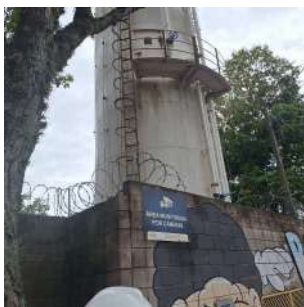
Foto 1 - Cercamento por muro - trecho com arame farpado rompido
