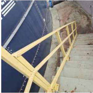
Foto 1 - Corrimão e guarda-corpos em escada de acesso ao Reservatório Apoiado B - São Vicente
