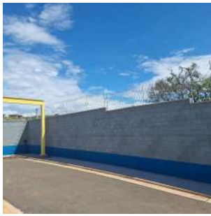
Foto 1 - Cercamento por muro com arame farpado - Reservatório Apoiado Artesano
