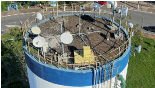
Foto 1 - Para-raios - Res Padre Anchieta Elevado
