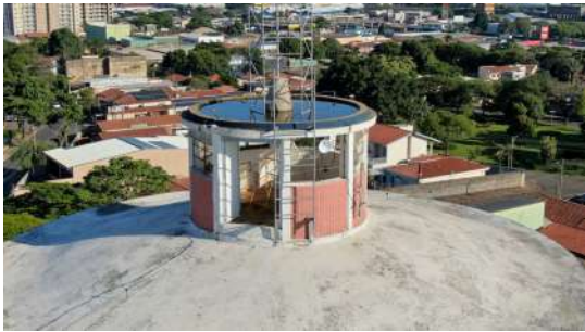
Foto 1 - Água parada na cobertura - Res Nova Aparecida Elevado
