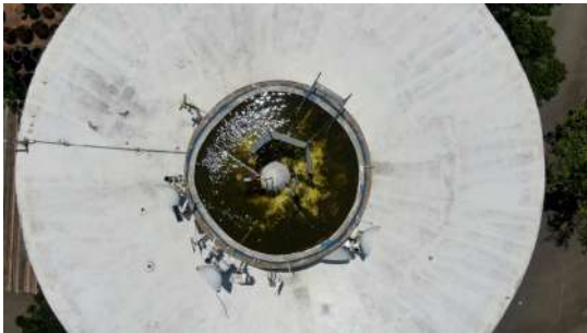
Foto 1 - Água parada na cobertura - Res Paranapanema Elevado
