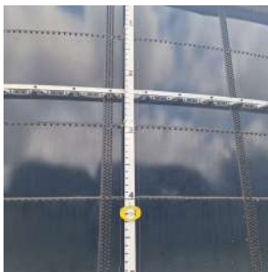
Foto 1 - Medidor de nível mecânico - Reservatório Campo Grande Semienterrado C
