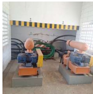
Foto 7 - Sopradores- envio de ar para a caixa de areia
