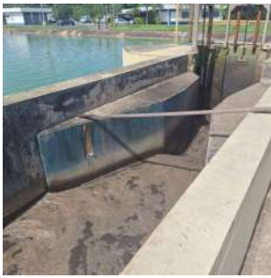
Foto 8 - Recirculação do lodo
