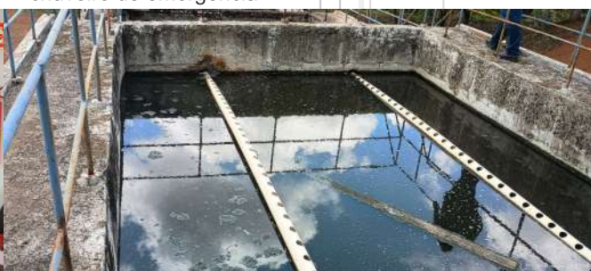
Foto 14 - Chegada do esgoto em um dos módulos de tratamento.
