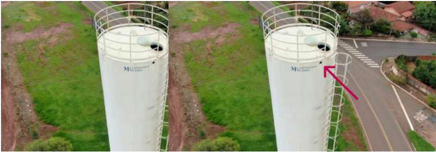
Foto 1 - Ausência de tela no vão de extravasamento. Foto 2 - Indicação do local sem tela de proteção.
