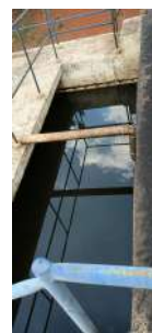
Foto 16 - Vista da parte superior de um dos módulos de tratamento.
