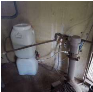
Foto 3 - Sistema de dosagem de cloro.
