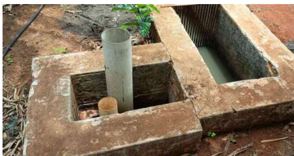
Foto 7 - Chegada do esgoto bruto.
