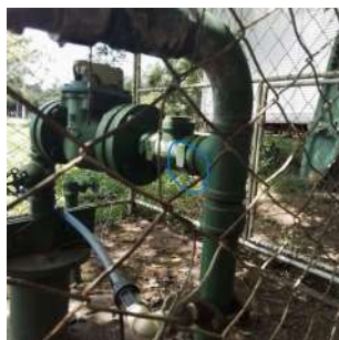
Foto 1 - Vazamento na rosca da válvula de retenção horizontal.
