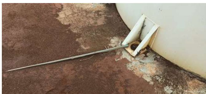
Foto 1 - Aterramento da estrutura do reservatório.
