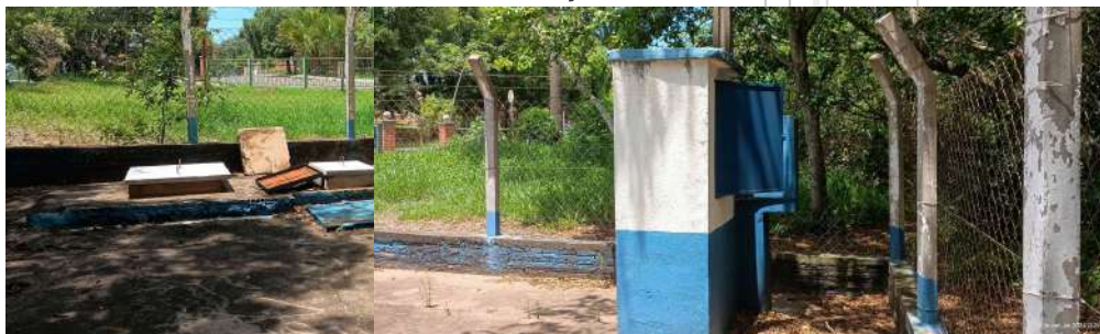
Foto 7 - Tampas dos poços de chegada do esgoto.
