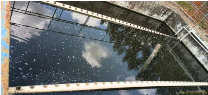
Foto 2 - Calhas e tubos desalinhados.
