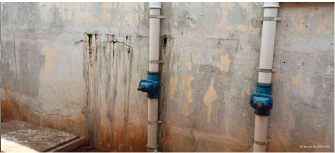
Foto 2 - Pontos de vazamentos na lateral de um dos módulos de tratamento.
