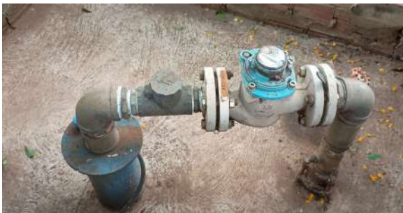
Foto 3 - Vista geral do cavalete do poço.
