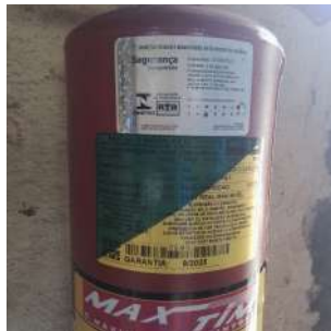
Foto 1 - Validade no extintor de incêndio.
