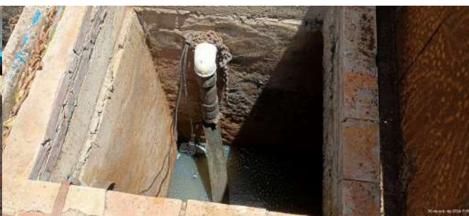
Foto 4 - Um dos poços de sucção com bomba submersa.
