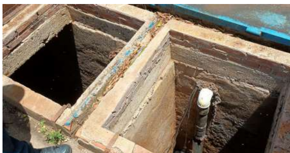
Foto 3 - Poços de sucção com bombas submersas.
