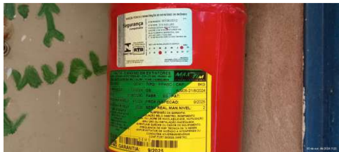
Foto 1 - Validade do extintor de incêndio.
