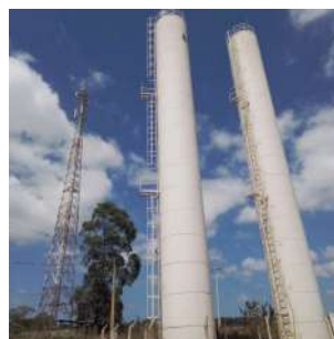
Foto 2 - Conjunto de reservatórios.
