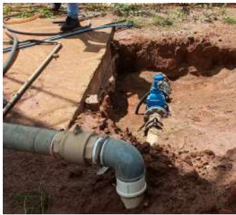
Foto 6 - Tubulação de chegada e saída da água para abastecimento.
