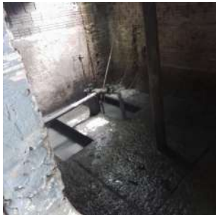
Foto 4 - Vista interna da EEEB.
