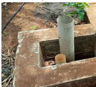
Foto 7 - Chegada do esgoto bruto.
