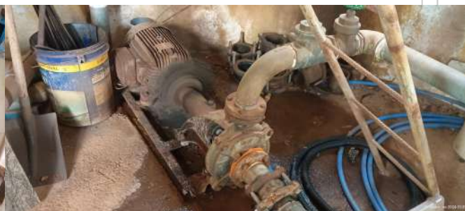
Foto 8 - Segundo conjunto motobomba da EEAT.
