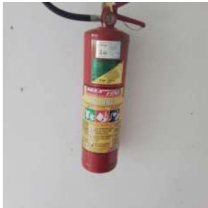
Foto 1 - Extintor de incêndio.
