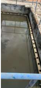
Foto 3 - Calhas e tubos desalinhados.
