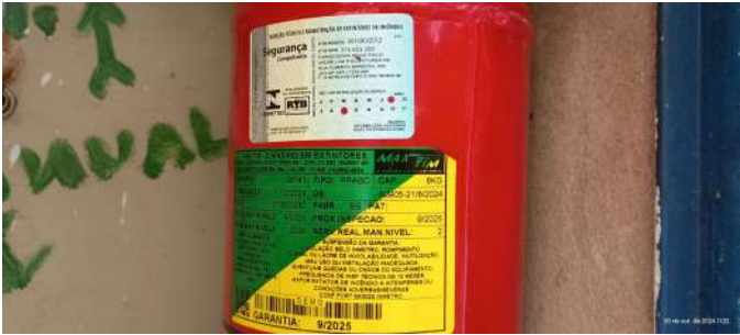
Foto 1 - Validade do extintor de incêndio.
