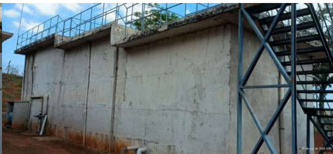
Foto 18 - Vista lateral de um dos módulos de tratamento.
