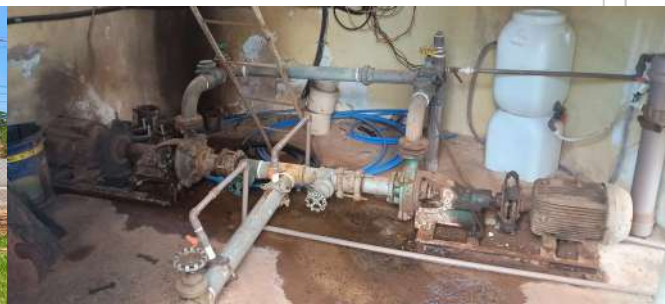
Foto 6 - Conjuntos motobomba (1+1R) da elevatória.
