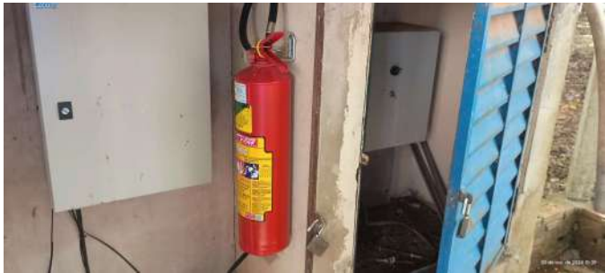
Foto 5 - Abrigos dos painéis elétricos e de comando do poço.
