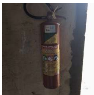
Foto 1 - Extintor de incêndio.
