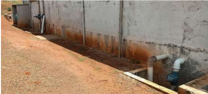
Foto 5 - Pontos de vazamentos na lateral de um dos módulos de tratamento.
