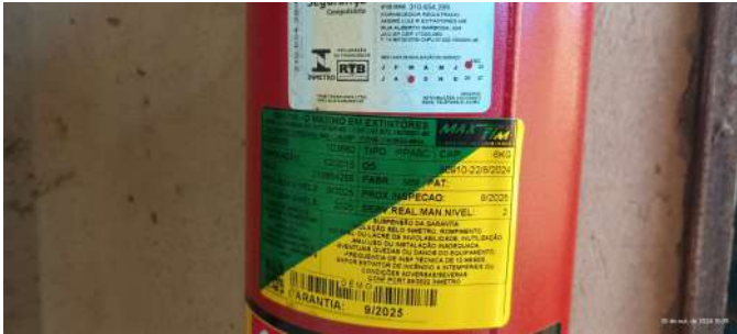
Foto 1 - Validade do extintor.
