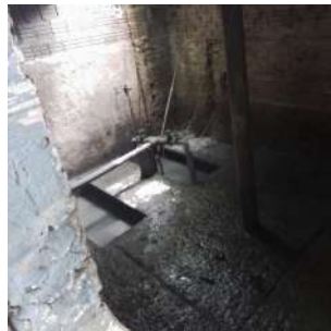
Foto 4 - Vista interna da EEEB.
