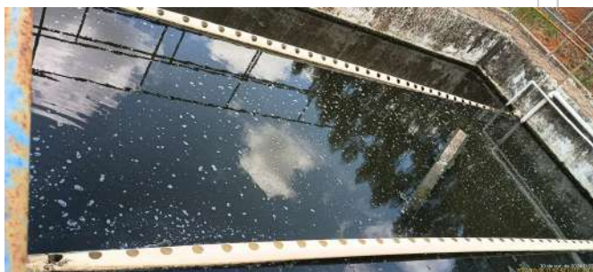
Foto 2 - Calhas e tubos desalinhados.
