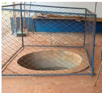
Foto 9 - Poços de lodo, com bombas para recirculação.
