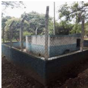
Foto 3 - Vista externa da EEEB.
