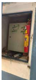
Foto 9 - Painel elétrico e de comando da EEE e extintor de incêndio.
