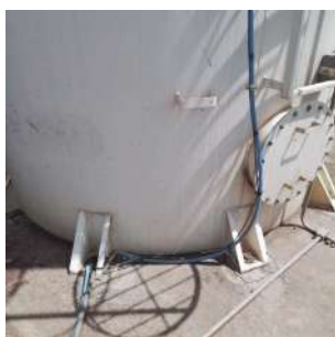
Foto 1 - Cabeamento do SPDA na base do reservatório.
