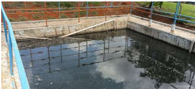
Foto 19 - Vista da parte superior de um dos módulos de tratamento.
