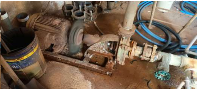
Foto 2 - Piso molhado no interior da EEAT devido à drenagem inadequada da água de lubrificação de gaxetas.
