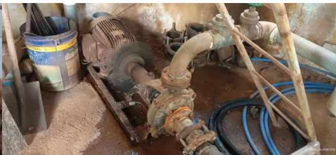
Foto 8 - Segundo conjunto motobomba da EEAT.
