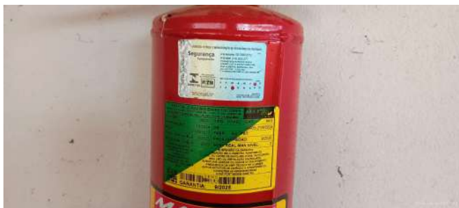
Foto 1 - Validade do extintor de incêndio.
