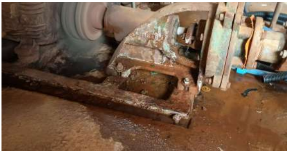
Foto 1 - Piso molhado no interior da EEAT devido à drenagem inadequada da água de lubrificação de gaxetas.
