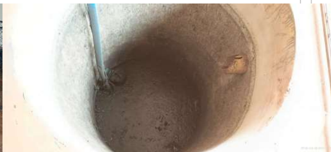
Foto 10 - Um dos poços de acúmulo de lodo para posterior recirculação.
