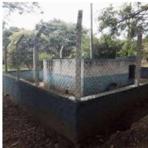
Foto 3 - Vista externa da EEEB.
