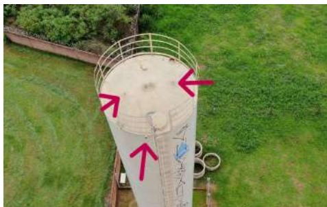
Foto 3 - Indicação dos tubos sem tela de proteção.
