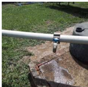
Foto 1 - Torneira para coleta de água bruta.
