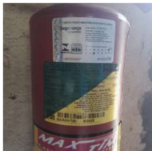
Foto 1 - Validade no extintor de incêndio.
