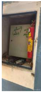
Foto 9 - Paineleletrico e de comando da EEE e extintor de incendio.
