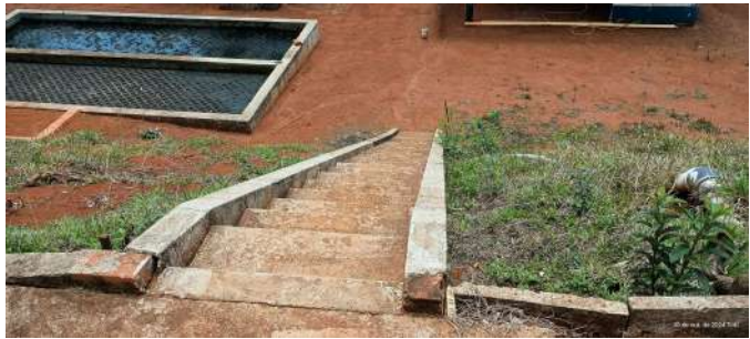
Foto 1 - Escada sem proteção (corrimão) adequada.
