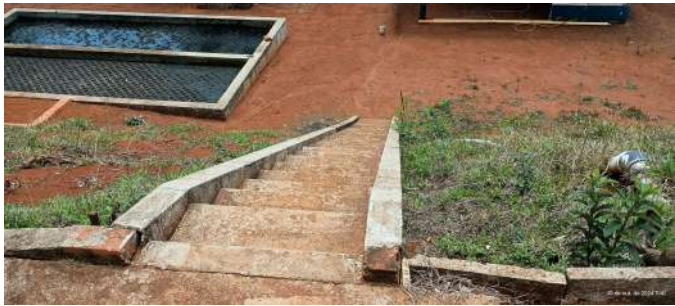
Foto 1 - Escada sem proteção (corrimão) adequada.
