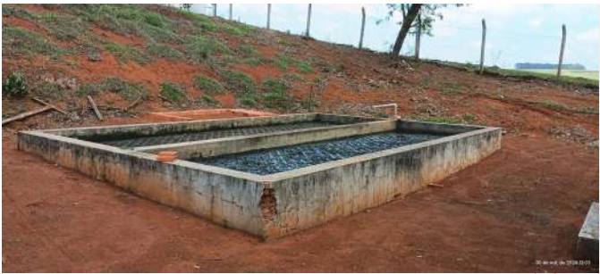
Foto 26 - Leito de secagem do lodo.
