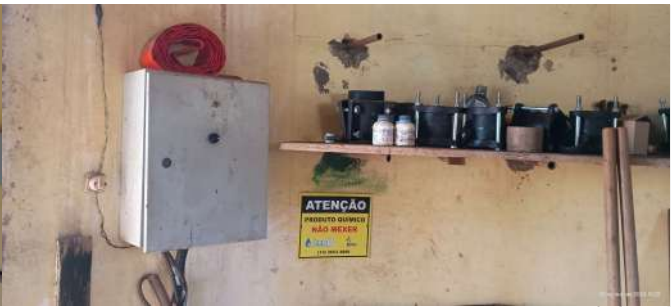
Foto 10 - Painel elétrico da EEAT.
