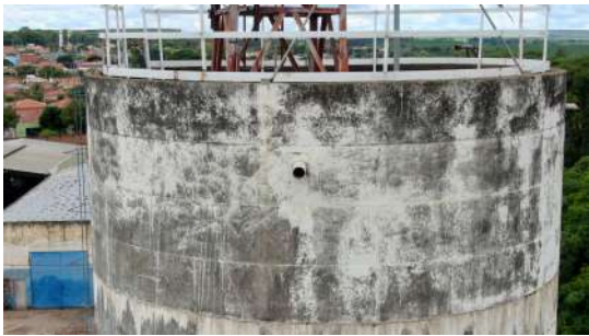
Foto 1 - Ausência de tela de proteção em tubo extravasor.
