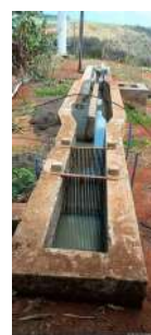
Foto 6 - Canal de chegada do esgoto bruto, com gradeamento (barras fixas) e caixas desarenadoras.
