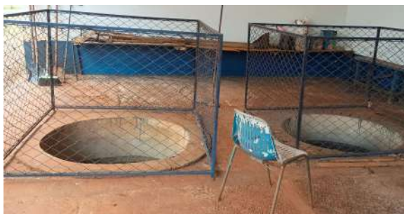
Foto 9 - Poços de lodo, com bombas para recirculação.
