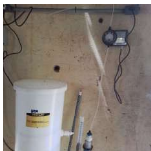
Foto 1 - Sistema de dosagem de flúor.
