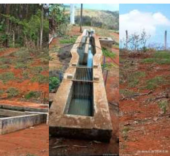
Foto 6 - Canal de chegada do esgoto bruto, com gradeamento (barras fixas) e caixas desarenadoras.
