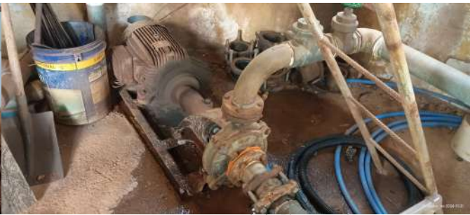
Foto 8 - Segundo conjunto motobomba da EEAT.
