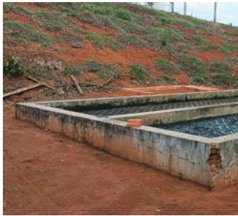
Foto 26 - Leito de secagem do lodo.
