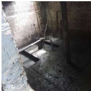
Foto 4 - Vista interna da EEEB.
