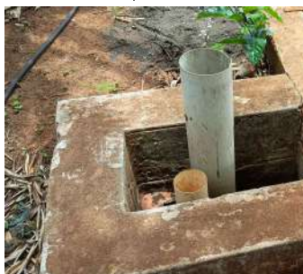
Foto 7 - Chegada do esgoto bruto.
