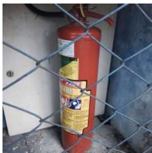
Foto 1 - Extintor de incêndio.
