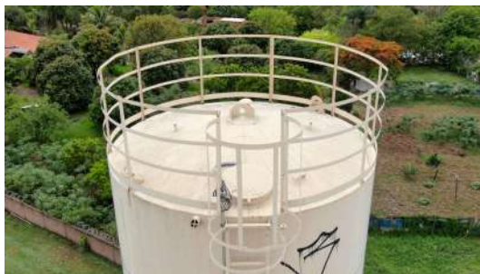
Foto 4 - Tubos sem tela de proteção no reservatório de cor amarela.
