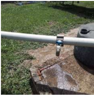
Foto 1 - Torneira para coleta de água bruta.
