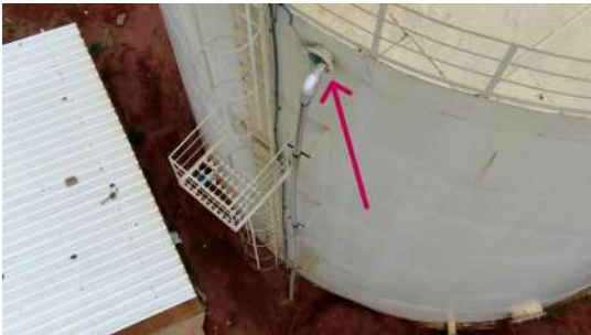
Foto 2 - Indicação do local exato sem tela de proteção.
