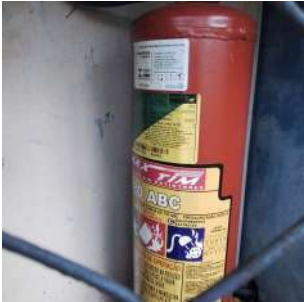
Foto 1 - Validade do extintor de incêndio.
