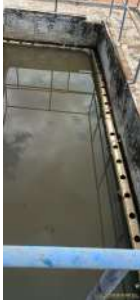
Foto 3 - Calhas e tubos desalinhados.
