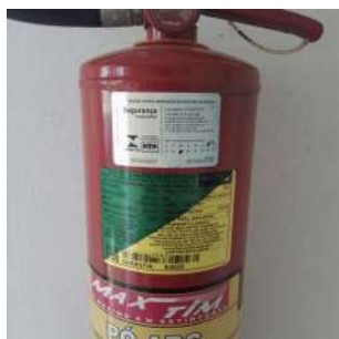
Foto 1 - Validade do extintor de incêndio.
