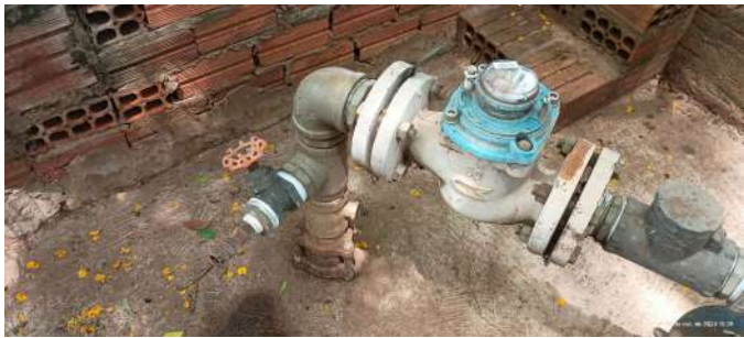
Foto 1 - Ponto para coleta de água bruta
