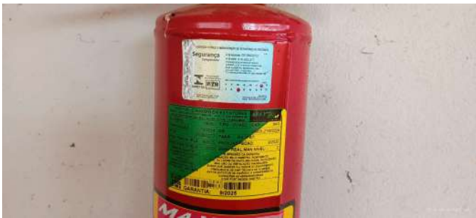
Foto 1 - Validade do extintor de incêndio.
