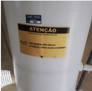
Foto 2 - Armazenamento de flúor.
