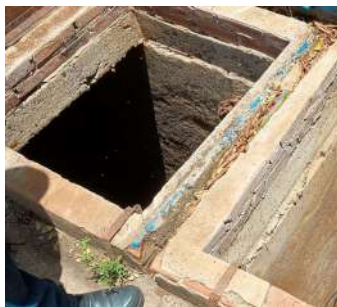
Foto 3 - Poços de sucção com bombas submersas.
