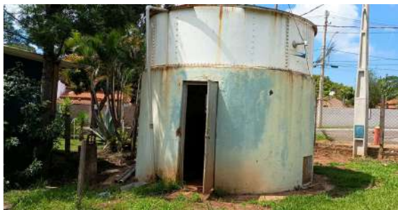
Foto 5 - Abrigo dos conjuntos motobomba da EEAT.
