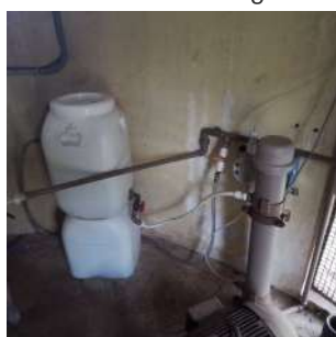
Foto 3 - Sistema de dosagem de cloro.
