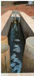
Foto 24 - Tanque de contato com hipoclorito, pós tratamento.
