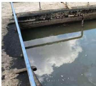
Foto 15 - Vista da parte superior de um dos módulos de tratamento.
