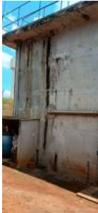
Foto 6 - Pontos de vazamentos na lateral de um dos módulos de tratamento.
