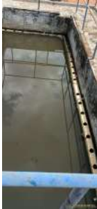
Foto 3 - Calhas e tubos desalinhados.
