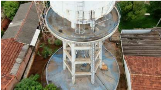
Foto 3 - Vista aérea lateral do reservatório, com manchas de vazamentos.
