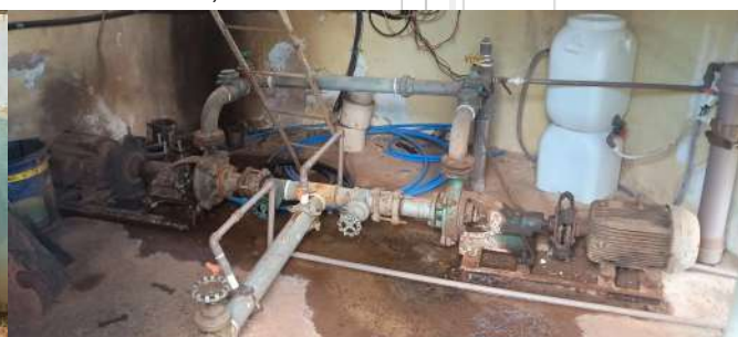
Foto 6 - Conjuntos motobomba (1+1R) da elevatória.
