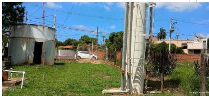
Foto 4 - Reservatório de transição (entre poços e EEAT).
