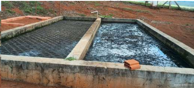
Foto 27 - Leito de secagem do lodo.
