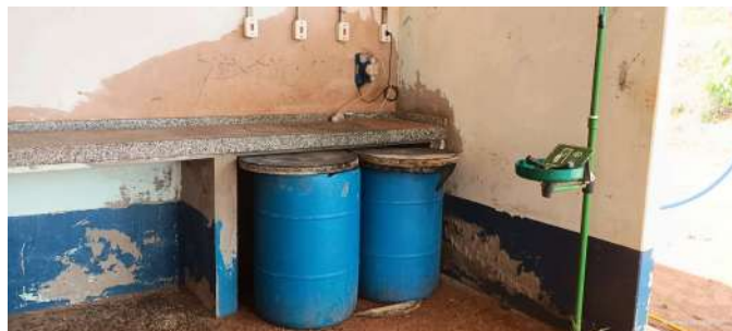
Foto 1 - Situação dos tambores de armazenamento de produtos químicos.
