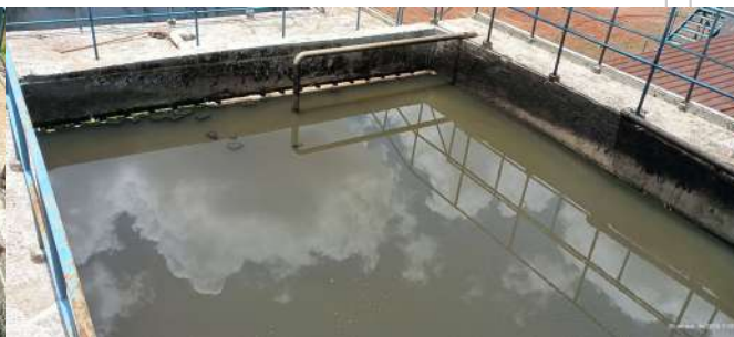
Foto 21 - Vista da parte superior de um dos módulos de tratamento.
