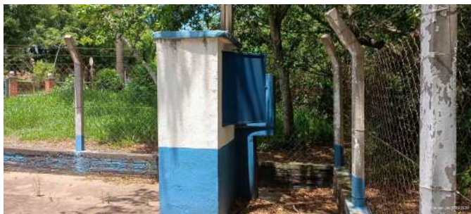
Foto 8 - Abrigo do painel elétrico e de comando da EEE.
