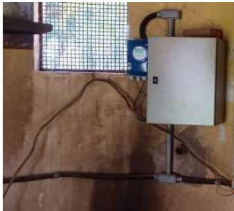
Foto 9 - Painel elétrico e de comando da EEAT.
