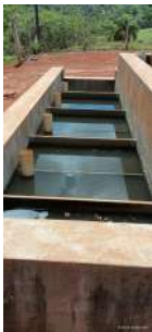
Foto 25 - Tanque de contato com hipoclorito, pós tratamento.
