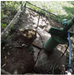
Foto 2 - Rachaduras na laje.
