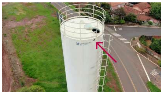
Foto 2 - Indicação do local sem tela de proteção.
