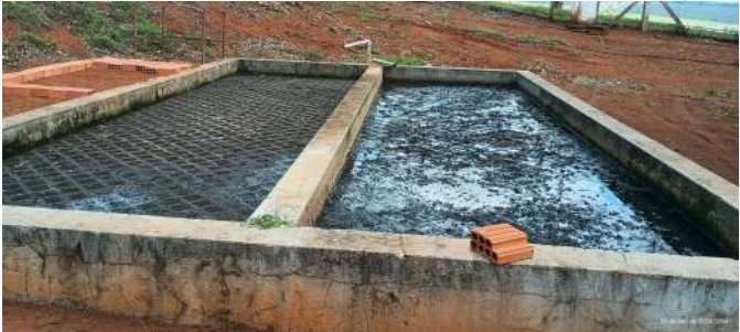
Foto 27 - Leito de secagem do lodo.
