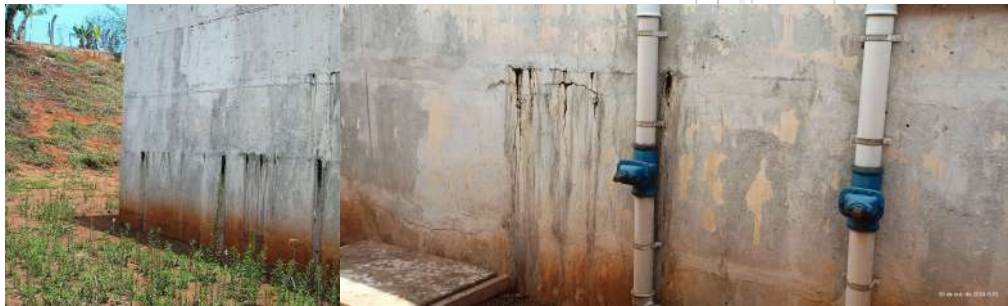
Foto 1 - Pontos de vazamentos na lateral de um dos módulos de tratamento.
