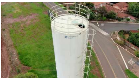
Foto 1 - Ausência de tela no vão de extravasamento.
