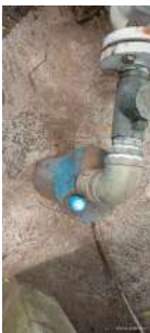
Foto 1 - Tubo para medição de nível na tubulação de proteção do poço.
