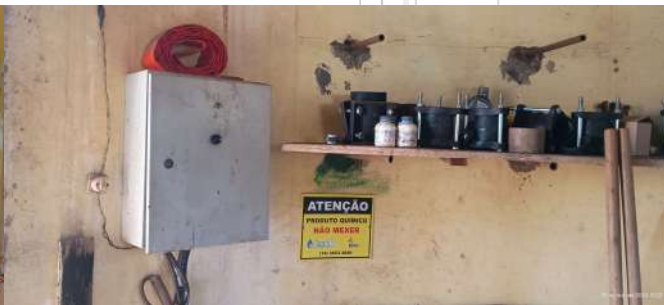
Foto 10 - Painel elétrico da EEAT.
