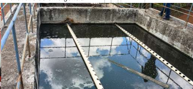
Foto 14 - Chegada do esgoto em um dos módulos de tratamento.
