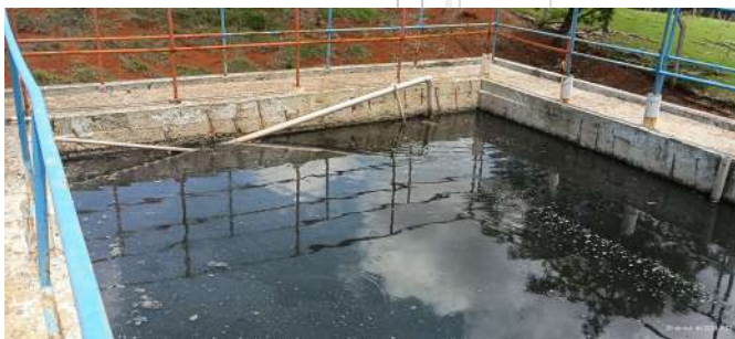
Foto 19 - Vista da parte superior de um dos módulos de tratamento.
