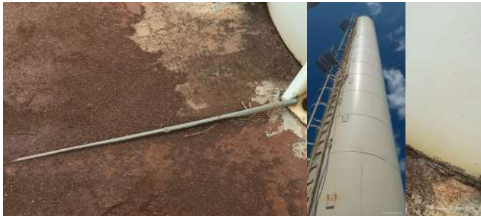
Foto 1 - Aterramento da estrutura do reservatório.
