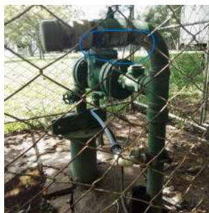
Foto 2 - Vazamento nas roscas do registro próximo ao CAP.
