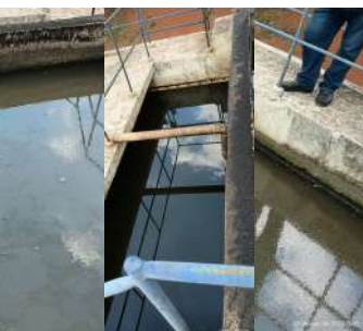
Foto 16 - Vista da parte superior de um dos módulos de tratamento.
