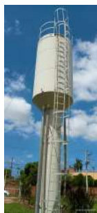
Foto 3 - Reservatório de transição (entre poços e EEAT).
