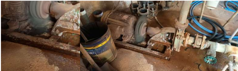
Foto 1 - Piso molhado no interior da EEAT devido à drenagem inadequada da água de lubrificação de gaxetas.
