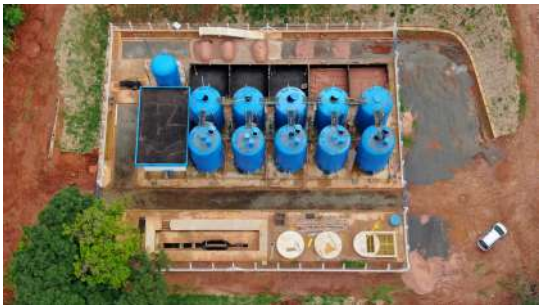
Foto 3 - Vista da ETE Modular compacta situada na ETE Cidade.
