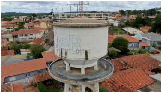
Foto 2 - Vista aérea lateral do reservatório, com manchas de vazamentos.
