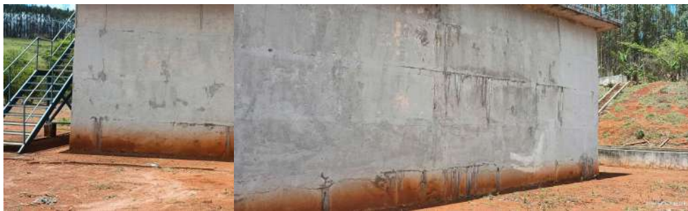
Foto 3 - Pontos de vazamentos na lateral de um dos módulos de tratamento.
