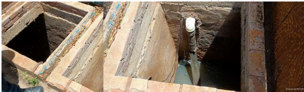
Foto 3 - Poços de sucção com bombas submersas.
