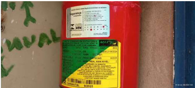
Foto 1 - Validade do extintor de incêndio.
