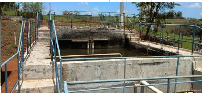
Foto 23 - Vista geral de um dos módulos de tratamento.
