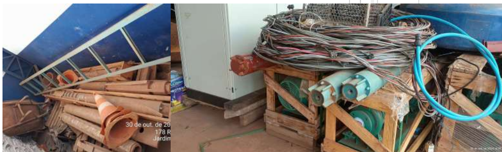
Foto 1 - Bombas no estoque da ETA. Foto 2 - Bombas no estoque da ETA.
