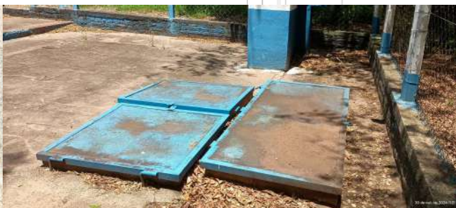
Foto 6 - Tampas dos poços de sucção.
