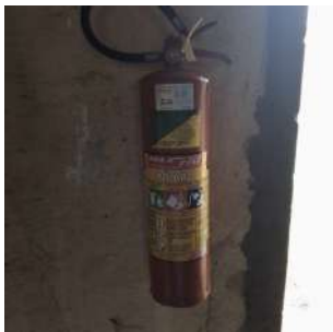
Foto 1 - Extintor de incêndio.
