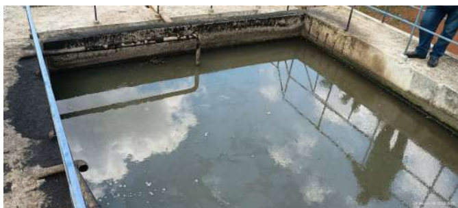
Foto 15 - Vista da parte superior de um dos módulos de tratamento.
