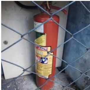
Foto 1 - Extintor de incêndio.
