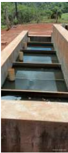
Foto 25 - Tanque de contato com hipoclorito, pós tratamento.
