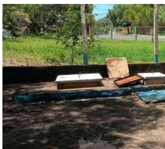
Foto 7 - Tampas dos poços de chegada do esgoto.
