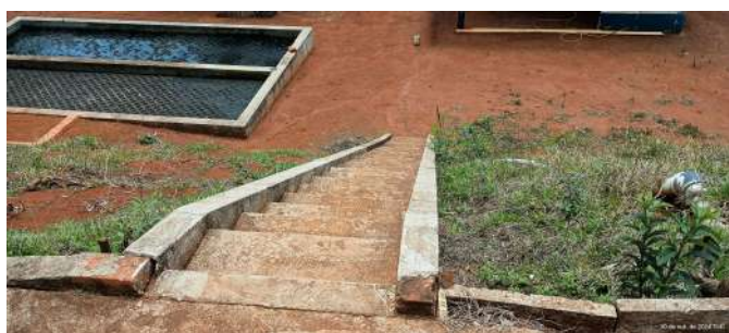
Foto 1 - Escada sem proteção (corrimão) adequada.
