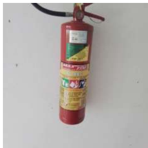
Foto 1 - Extintor de incêndio.
