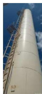
Foto 2 - Sistema de descida do SPDA.
