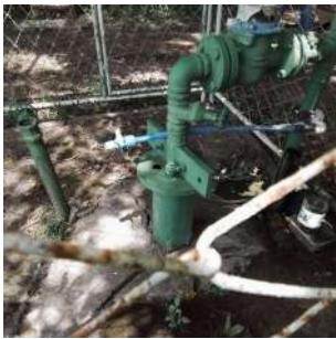
Foto 1 - Buraco na flange de proteção.
