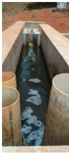
Foto 24 - Tanque de contato com hipoclorito, pós tratamento.
