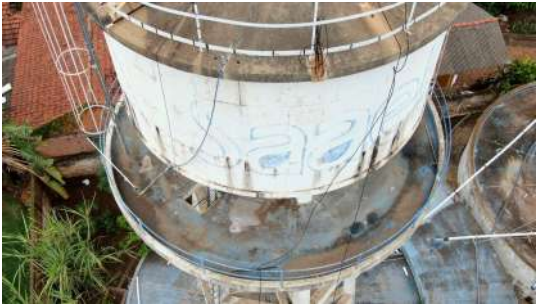
Foto 4 - Vista aérea lateral do reservatório, com manchas de vazamentos.
