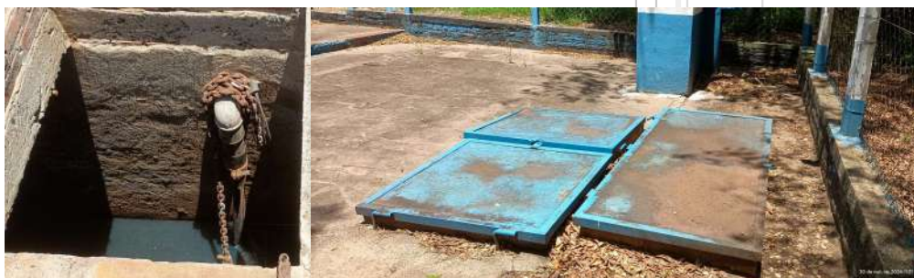
Foto 5 - Poços de sucção com bombas submersas.
