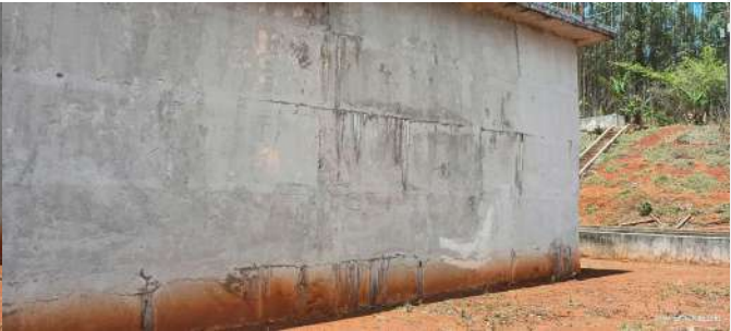
Foto 4 - Pontos de vazamentos na lateral de um dos módulos de tratamento.
