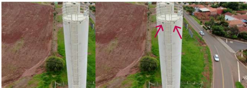
Foto 1 - Ausência de tela de proteção nas duas saídas de tubulação na parte superior.
