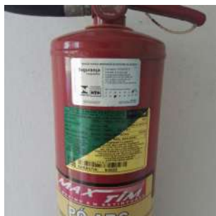
Foto 1 - Validade do extintor de incêndio.
