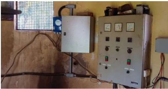
Foto 9 - Painel elétrico e de comando da EEAT.
