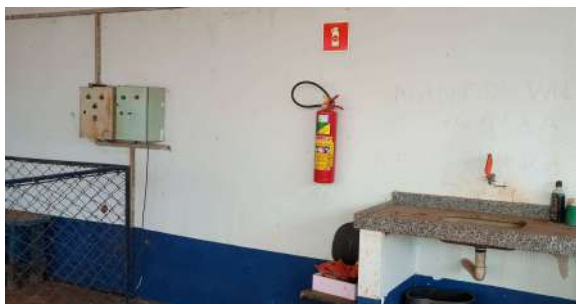
Foto 13 - Extintor de incêndio e alguns dos painéis elétricos da ETE.
