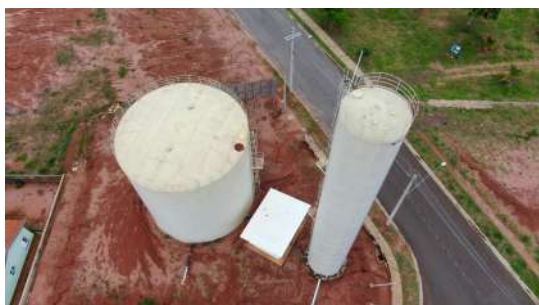
Foto 7 - Vista aérea dos dois reservatórios do Jd. Santa Maria.
