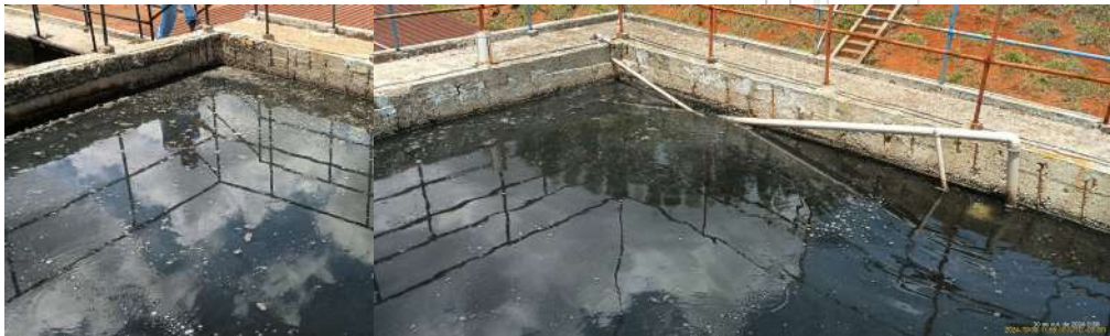
Foto 4 - Ferragem exposta, com sinais de oxidação.
