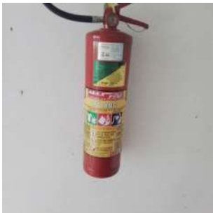
Foto 1 - Extintor de incêndio.
