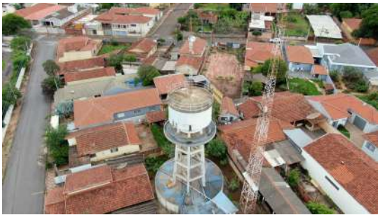
Foto 1 - Vista aérea lateral do reservatório, com manchas de vazamentos.
