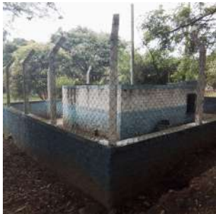
Foto 3 - Vista externa da EEEB.
