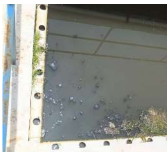
Foto 22 - Vista da parte superior de um dos módulos de tratamento, com canaletas e tubos de coleta do esgoto.
