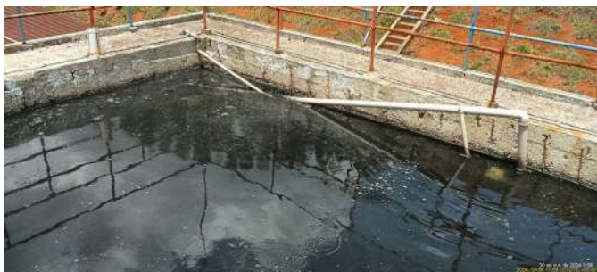
Foto 5 - Ferragem exposta, com sinais de oxidação.
