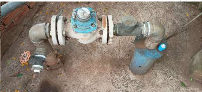
Foto 4 - Vista geral do cavalete do poço.
