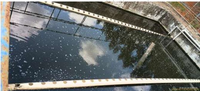
Foto 2 - Calhas e tubos desalinhados.
