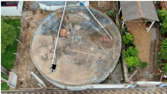
Foto 1 - Ausência de tampa de inspeção na cobertura do reservatório.
