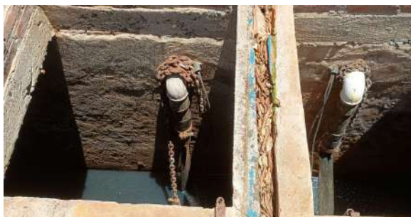
Foto 5 - Poços de sucção com bombas submersas.
