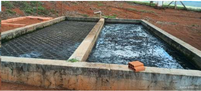
Foto 27 - Leito de secagem do lodo.
