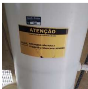
Foto 2 - Armazenamento de flúor.
