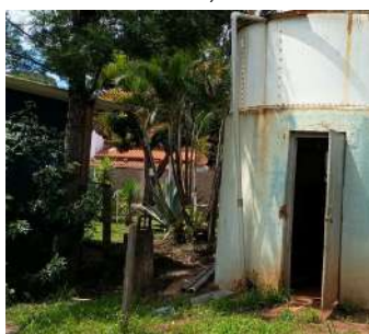
Foto 5 - Abrigo dos conjuntos motobomba da EEAT.
