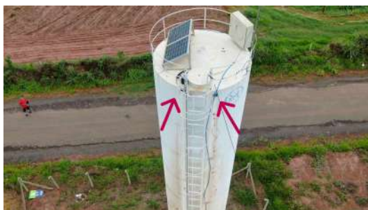
Foto 2 - Indicação do local sem telas de proteção.
