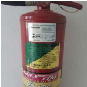
Foto 1 - Validade do extintor de incêndio.
