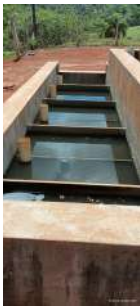
Foto 25 - Tanque de contato com hipoclorito, pós tratamento.
