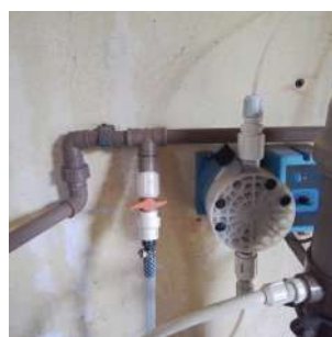
Foto 4 - Bomba de dosagem de cloro
