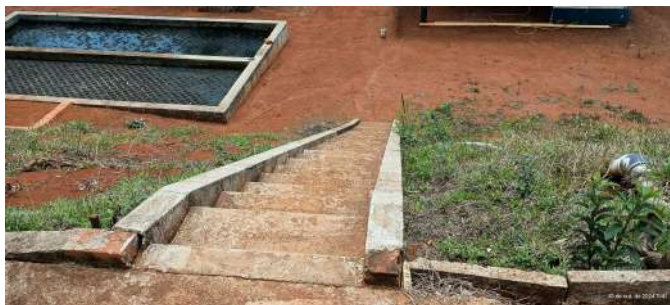
Foto 1 - Escada sem proteção (corrimão) adequada.
