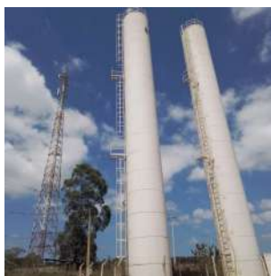
Foto 2 - Conjunto de reservatórios.
