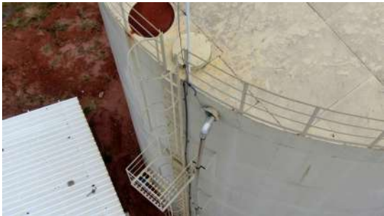
Foto 1 - Ausência de tela de proteção.
