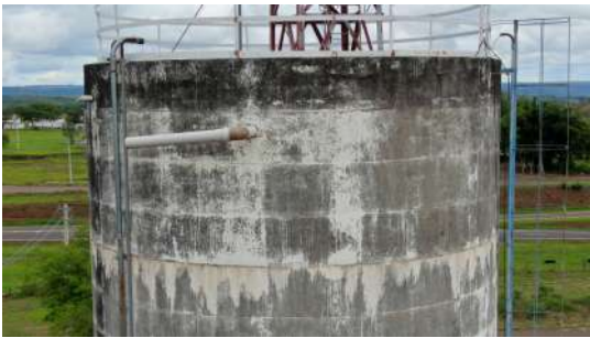
Foto 2 - Ausência de tela de proteção em tubo extravasor.
