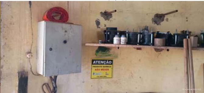
Foto 10 - Painel elétrico da EEAT.
