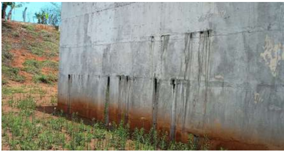
Foto 1 - Pontos de vazamentos na lateral de um dos módulos de tratamento.
