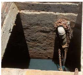
Foto 5 - Poços de sucção com bombas submersas.
