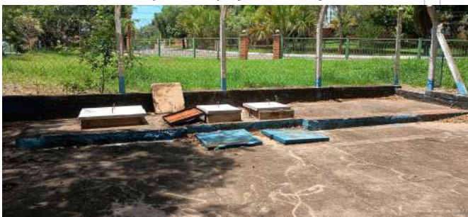
Foto 7 - Tampas dos poços de chegada do esgoto.
