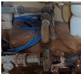
Foto 7 - Primeiro conjunto motobomba da EEAT.
