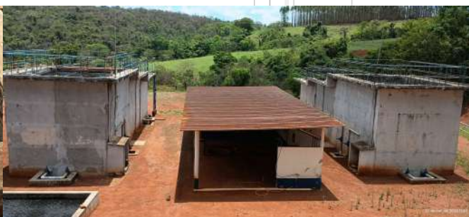
Foto 8 - Vista dos dois módulos de tratamento da ETE.
