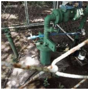
Foto 1 - Buraco na flange de proteção.
