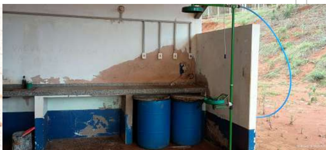
Foto 12 - Tambores de armazenamento de produtos químicos (hipoclorito), chuveiro de emergência.
