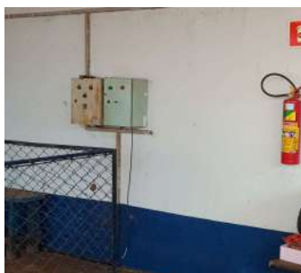
Foto 13 - Extintor de incêndio e alguns dos painéis elétricos da ETE.
