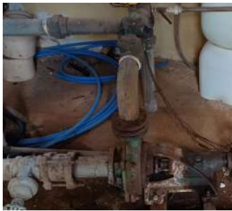
Foto 7 - Primeiro conjunto motobomba da EEAT.
