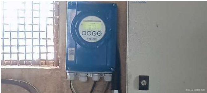
Foto 11 - Monitor da macromedição na EEAT.
