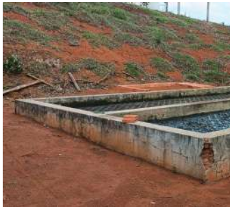
Foto 26 - Leito de secagem do lodo.
