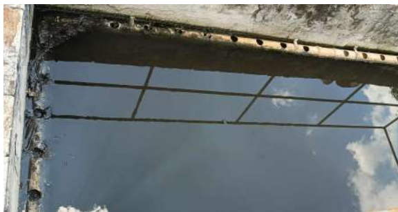
Foto 17 - Vista da parte superior de um dos módulos de tratamento, com canaletas e tubos de coleta do esgoto.
