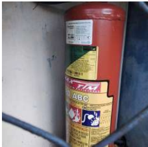
Foto 1 - Validade do extintor de incêndio.
