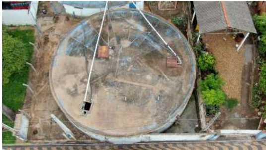
Foto 1 - Ausência de tampa de inspeção na cobertura do reservatório.
