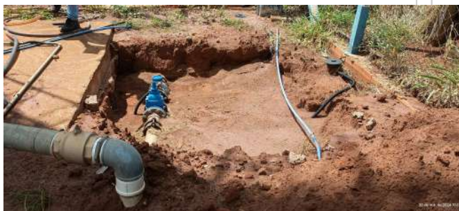
Foto 6 - Tubulação de chegada e saída da água para abastecimento.
