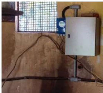
Foto 9 - Painel elétrico e de comando da EEAT.
