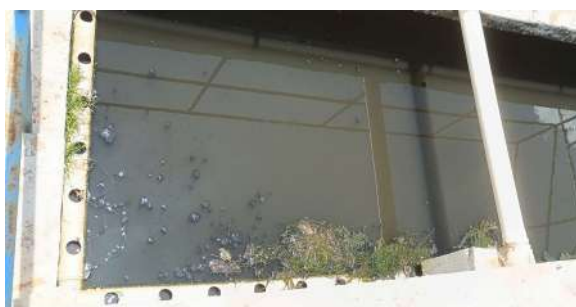
Foto 22 - Vista da parte superior de um dos módulos de tratamento, com canaletas e tubos de coleta do esgoto.
