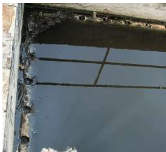
Foto 17 - Vista da parte superior de um dos módulos de tratamento, com canaletas e tubos de coleta do esgoto.
