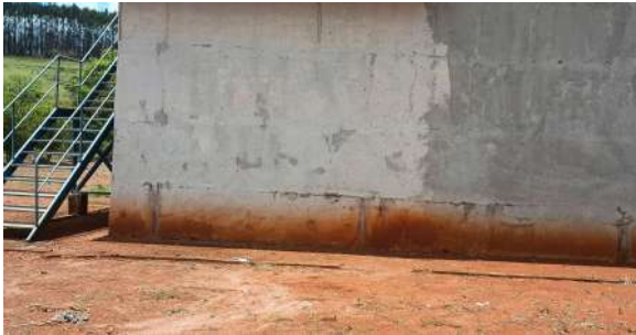
Foto 3 - Pontos de vazamentos na lateral de um dos módulos de tratamento.
