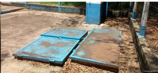
Foto 6 - Tampas dos poços de sucção.
