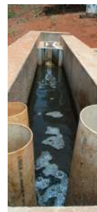
Foto 24 - Tanque de contato com hipoclorito, pós tratamento.
