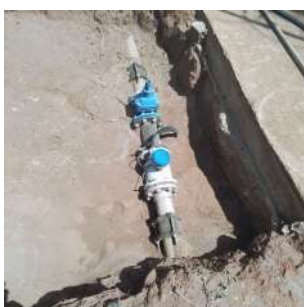
Foto 4 - Medidor de vazão eletromagnético recém-instalado na saída dos reservatórios.
