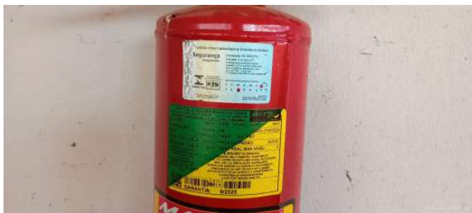
Foto 1 - Validade do extintor de incêndio.
