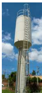
Foto 3 - Reservatório de transição (entre poços e EEAT).
