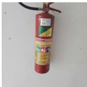
Foto 1 - Extintor de incêndio.
