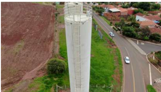
Foto 1 - Ausência de tela de proteção nas duas saídas de tubulação na parte superior.
