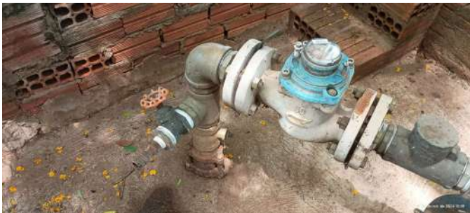
Foto 1 - Ponto para coleta de água bruta
