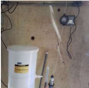
Foto 1 - Sistema de dosagem de flúor.
