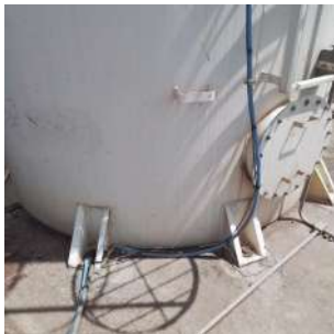
Foto 1 - Cabeamento do SPDA na base do reservatório.
