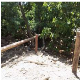
Foto 6 - Em virtude da desativação da elevatória antiga, o efluente estava sendo lançado in natura no local.
