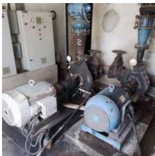
Foto 1 - Duas bombas instaladas no local.
