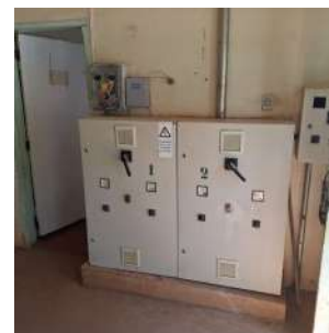
Foto 5 - Painéis de comando das bombas.
