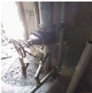
Foto 1 - Vazamento verificado em tubulação no interior da câmara inferior.
