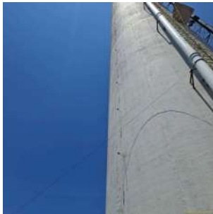
Foto 1 - Não havia cabo de descida do aterramento.
