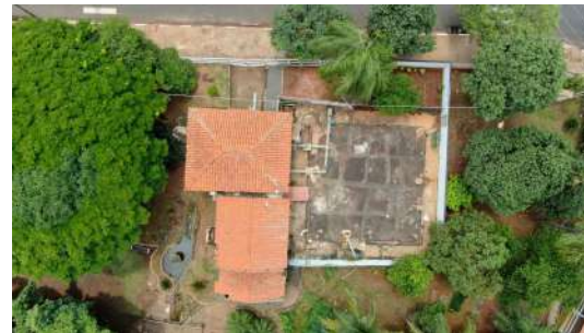
Foto 7 - Imagem aérea do reservatório e elevatória de água do Bosquinho. Imagem obtida com drone.
