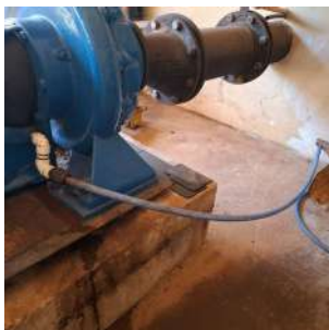
Foto 1 - Tubulação e mangueira para drenar a água de lubrificação da gaxeta de uma das bombas.
