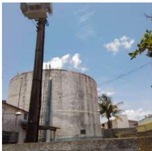
Foto 3 - Para-raios e cabo de descida do aterramento.
