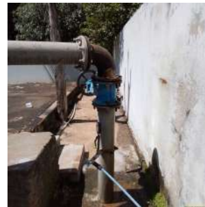
Foto 2 - Tubulação de alimentação do reservatório vinda da ETA. Vazamento verificado em uma junção.
