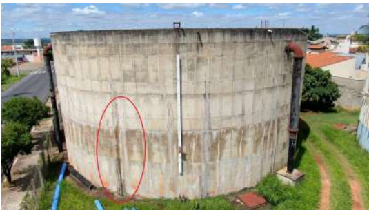
Foto 1 - Vazamento verificado no reservatório, em destaque na foto.
