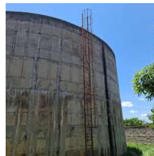
Foto 2 - Recomenda-se a pintura da escada.
