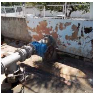
Foto 4 - Tubulação proveniente do reservatório Monte Castelo (garagem).
