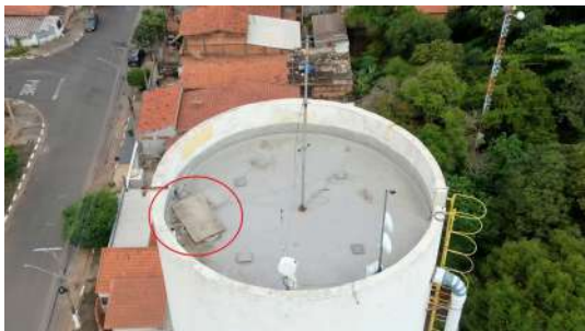
Foto 1 - Verificou-se que existe uma tampa improvisada, aparentemente de madeira. Porém, este material não é adequado para
