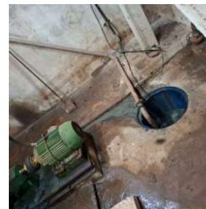
Foto 4 - O efluente proveniente dos vazamentos escoar até uma caixa, a partir da qual é bombeado de volta para o poço úmido.
