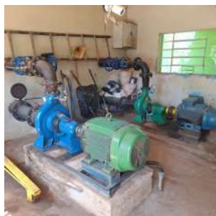
Foto 4 - Interior da casa de bombas.
