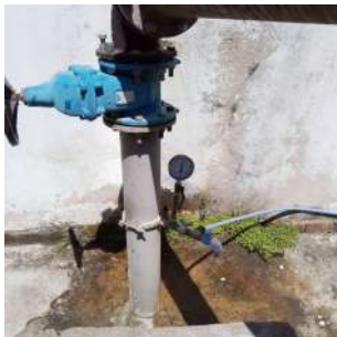
Foto 6 - Manômetro na entrada do reservatório.
