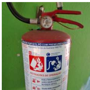
Foto 3 - Extintor com carga baixa.
