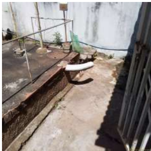
Foto 1 - Tubo extravasor serve como ventilação.
