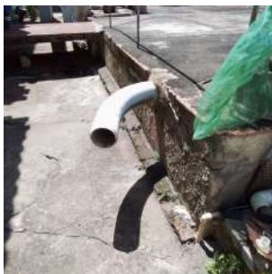
Foto 1 - Ausência de tela de proteção no tubo extravasor.
