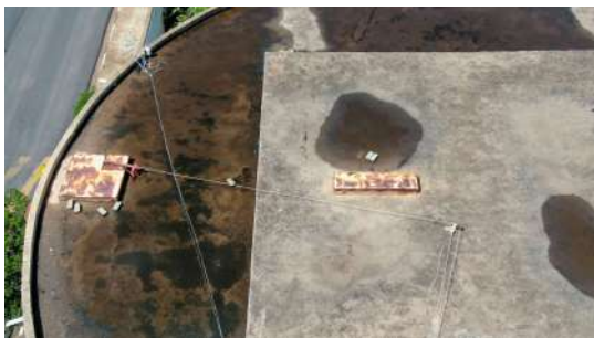
Foto 1 - Tampas de inspeção do reservatório: apesar de apresentarem marcas de corrosão, pelas imagens obtidas estão íntegras.
