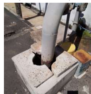
Foto 3 - Entrada de água proveniente da ETA.
