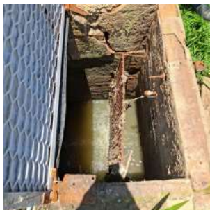
Foto 1 - Gradeamento no poço de chegada do efluente.
