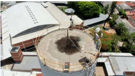
Foto 3 - Na cobertura do reservatório não há captor do SPDA.
