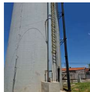
Foto 2 - Tubo extravasor no reservatório.
