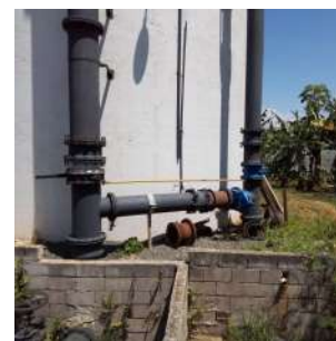
Foto 4 - By pass que conecta a tubulação de entrada (à direita) e de saída (esquerda).
