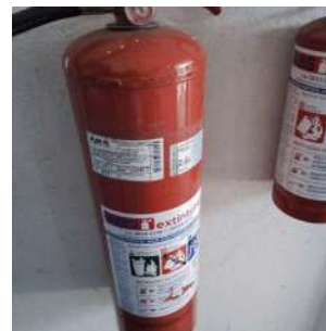
Foto 2 - Indicação de manutenção vencida.
