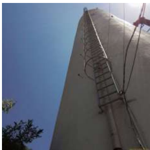
Foto 1 - Ausência de cabo para aterramento.
