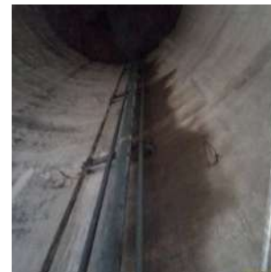
Foto 2 - Marcas causadas por vazamentos no interior da câmara inferior.
