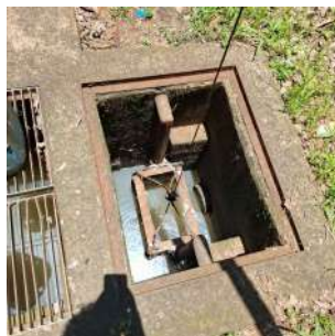
Foto 1 - Cesto peneira da elevatória.
