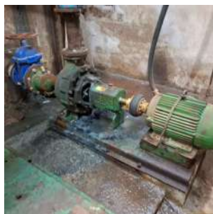
Foto 1 - Vazamento na gaxeta da bomba.
