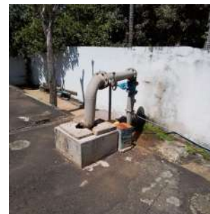
Foto 2 - Tubulação de entrada proveniente da ETA.
