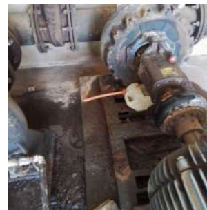
Foto 5 - Recipiente adaptado para drenar água de lubrificação da outra bomba, que estava desligada durante a Fiscalização.
