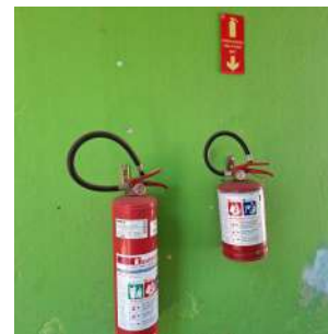
Foto 2 - Extintores de incêndio da elevatória.
