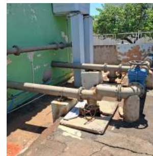
Foto 7 - Tubulações de sucção, provenientes do reservatório enterrado, e de recalque.
