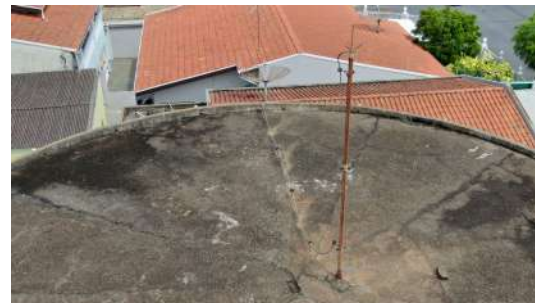
Foto 4 - Para-raios na cobertura.
