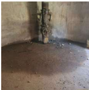
Foto 3 - Marcas de vazamentos na câmara inferior do reservatório.
