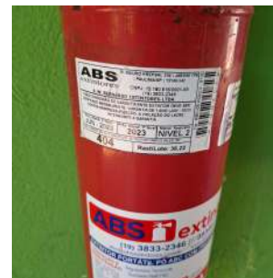
Foto 2 - Extintor com manutenção vencida.
