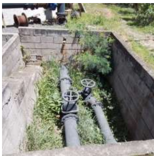
Foto 3 - Prestador deve remover mato das caixas que abrigam os registros das tubulações de entrada e saída.
