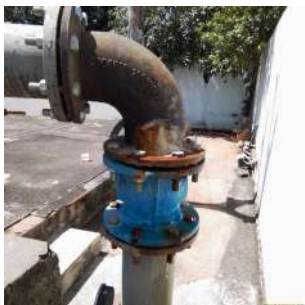
Foto 3 - Detalhe do vazamento.
