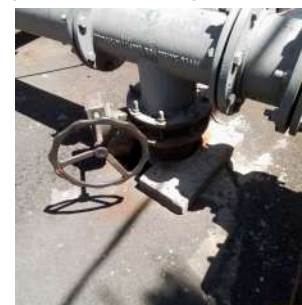
Foto 3 - Aberturas verificadas ao redor das tubulações de alimentação do reservatório.
