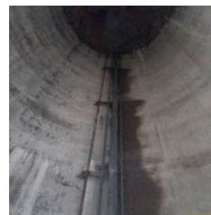
Foto 5 - Marcas causadas por vazamentos no interior da câmara inferior.
