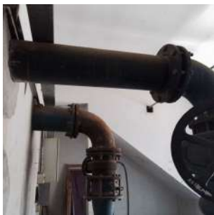
Foto 1 - Tubulações de recalque.
