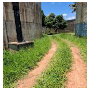
Foto 2 - Mato alto ao redor do reservatório, necessitando de capina.
