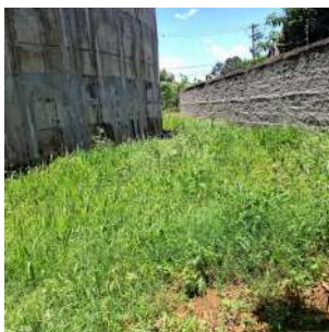
Foto 5 - Mato alto ao redor do reservatório, necessitando de capina.
