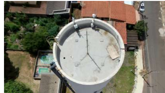
Foto 2 - Existe o captor do SPDA na cobertura, porém não há aterramento.
