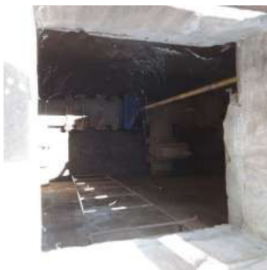
Foto 3 - Tubulação de saída do reservatório.
