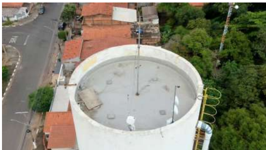
Foto 3 - Não há descida do aterramento.
