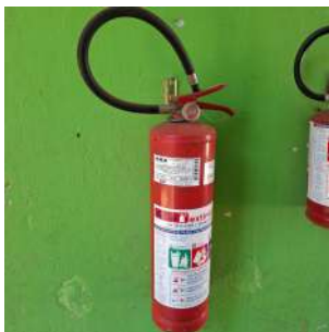
Foto 1 - Extintores de incêndio da elevatória.
