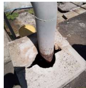
Foto 2 - Ausência de manta ao redor das tubulações de alimentação do reservatório.
