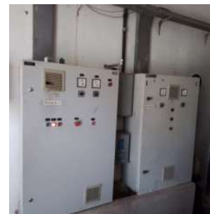
Foto 2 - Pannel de comando das bombas.
