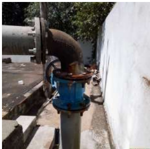
Foto 1 - Vazamento verificado em junção da tubulação de entrada do reservatório, proveniente da ETA.
