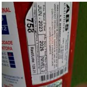
Foto 1 - Extintor com manutenção válida.
