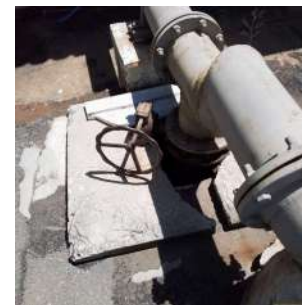
Foto 2 - Aberturas do reservatório estão desprotegidas contra a entrada de objetos, animais, água de chuva etc.
