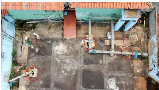
Foto 4 - Imagem aérea destacando as aberturas que devem ser vedadas.
