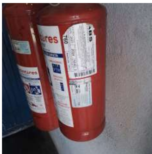
Foto 1 - Indicação de manutenção vencida.
