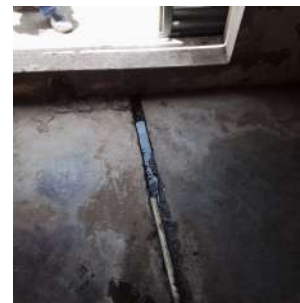
Foto 2 - Canaleta para escoar a água.
