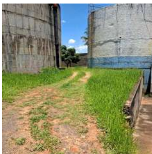
Foto 3 - Mato alto ao redor do reservatório, necessitando de capina.
