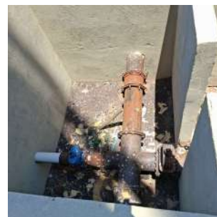
Foto 6 - Tubulação de saída do reservatório.
