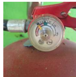
Foto 4 - Extintor com carga baixa.
