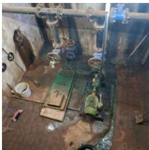
Foto 1 - Apenas uma bomba instalada.
