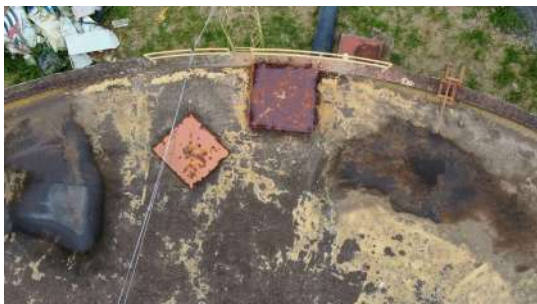
Foto 1 - Tampa de inspeção na cobertura do reservatório: bastante corroída, sendo necessária a substituição.
