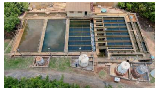
Foto 3 - ETA composta por 2 decantadores convencionais e 2 de alta taxa, sistema de floculação com 4 floculadores mecânicos (à direita) e seis filtros rápidos de areia e pedregulho. Na imagem, observa-se também tanques para armazenamento de produtos químicos com diques de proteção.
