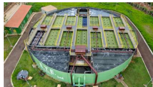
Foto 6 - Unidade Compacta de Tratamento Primário e Secundário, composto por: Sistema Unitário para 1ª etapa, compartimentado em aço, incluindo Reatores Anaeróbios de manta de Lodo e Fluxo Ascendente (UASB), Biofiltros Nitrificantes (BF) e Decantador Secundário, bem como
