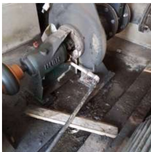
Foto 1 - Tubulação para drenar água de lubrificação das gaxetas de uma das bombas.
