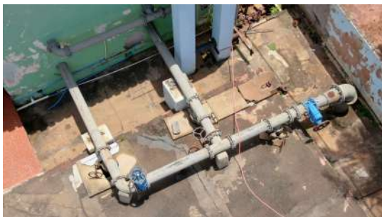
Foto 8 - Tubulação proveniente do Monte Castelo e abastecendo o Bosquinho, podendo também ser direcionada para a elevatória de água para recalque.
