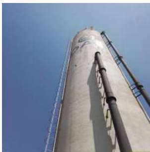
Foto 1 - Cabos do medidor de nível estouraram, de acordo com funcionário. Medidor não funciona.
