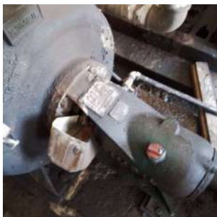
Foto 6 - Tubulação para drenar a água da bomba que estava em operação.
