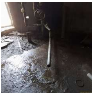
Foto 3 - De acordo com funcionários do DAE, as tubulações do interior da câmara estão sem uso; porém, verificou-se vazamentos nas tubulações.
