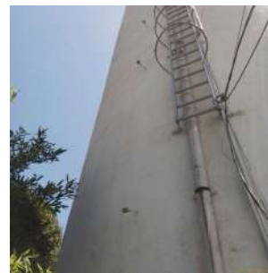
Foto 2 - Ausência de cabo para aterramento.
