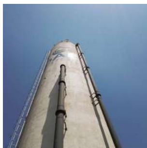
Foto 5 - Tubulações de saída (esq.) e alimentação (dir.).
