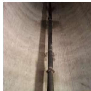
Foto 2 - Tubulação que apresentava vazamentos.
