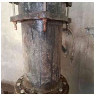
Foto 1 - Vazamento verificado na tubulação de saída do reservatório.
