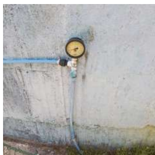
Foto 3 - Manômetro na entrada do reservatório, para verificação da pressão com que a água chega.
