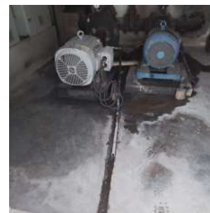
Foto 3 - Canaleta para escoar a água.
