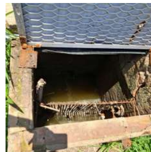
Foto 2 - Gradeamento no poço de chegada do efluente.
