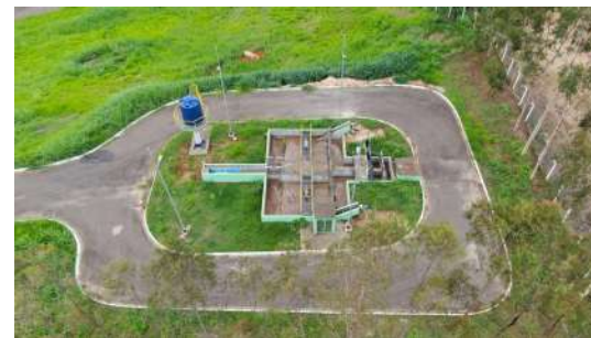
Foto 2 - Tratamento preliminar composto por Calha Parshall, Grade Cremalheira com sistema de limpeza automatizada de descarregamento em caçambas, desarenador mecanizado, mecanismo de raspagem mecanizado e caixa de distribuição de vazões.
