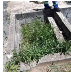
Foto 4 - Prestador deve remover mato das caixas que abrigam os registros das tubulações de entrada e saída.
