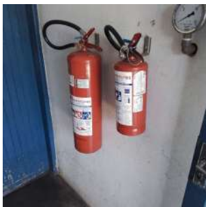
Foto 1 - Extintores no local.
