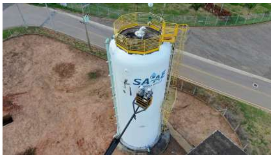
Foto 1 - Ausência de para-raios - Reservatório Elevado 35 -Soamin
