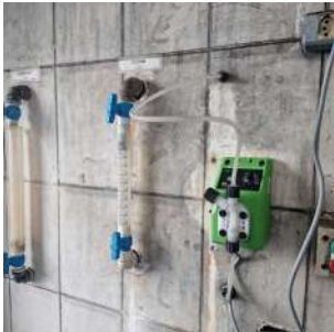
Foto 1 - Dosagem de flúor
