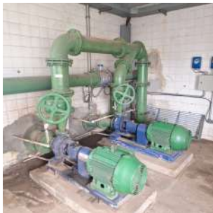
Foto 2 - Dois conjuntos motobomba instalados - EEA 4 (São Marcos, Popular)
