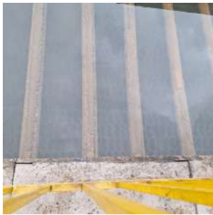
Foto 6 - Decantador lamelar - ETA
