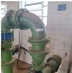
Foto 2 - Tubulação - indicação de envio para setor Vila América
