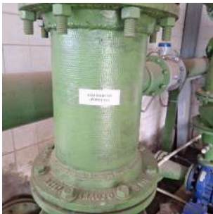
Foto 3 - Tubulação - recalque para São Marcos - EEA 4 (São Marcos, Popular)
