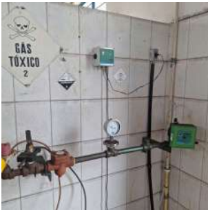
Foto 2 - Sistema - dosagem cloro gás - ETA
