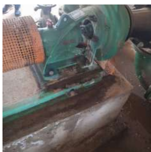
Foto 1 - Água de lubrificação de gaxeta sem a devida drenagem
