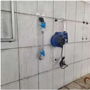
Foto 4 - Dosagem - Ortofosfato - ETA
