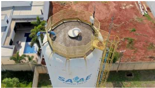
Foto 1 - Presença de para-raios - Reservatório Elevado 34 - Flamboyant
