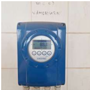
Foto 4 - Macromedidor digital - EEA 3 (Vila América)
