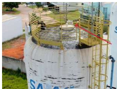
Foto 1 - Tela de proteção - Reservatório Elevado 31 - Flamboyant
