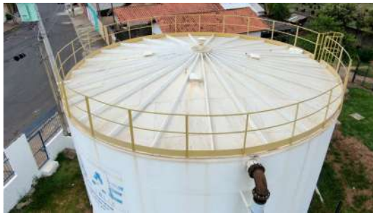
Foto 1 - Tela de proteção envolvendo as ventilações - Reservatório Apoiado 18 - CR Popular
