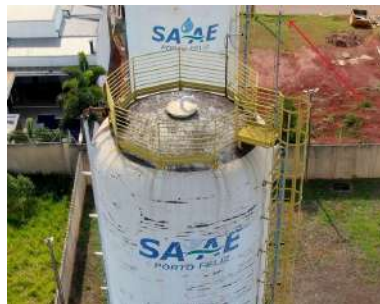
Foto 1 - Para-raios - Reservatório Elevado 31 - Flamboyant
