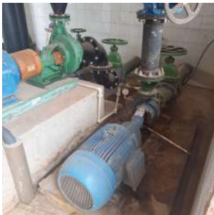
Foto 1 - Conjunto motobomba instalado e reserva
