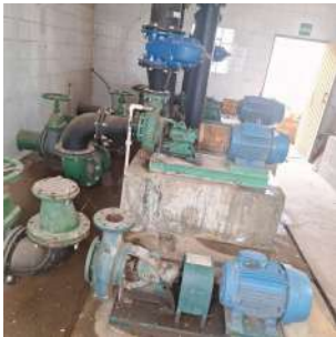
Foto 1 - Visão dos conjunto motobomba da EEA 2 - Justapostas - ETA (Progresso)
