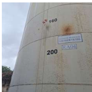
Foto 1 - Medidor de nível mecânico - Reservatório de lavagem de filtro da ETA
