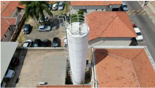
Foto 1 - Para-raios - Reservatório Elevado 05 - Prefeitura
