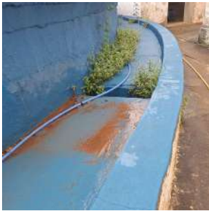
Foto 1 - Vegetação no Reservatório enterrado circular - ETA
