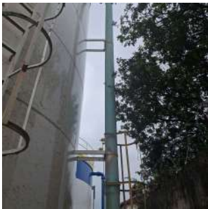
Foto 1 - Extravasor - Reservatório de lavagem de filtro da ETA
