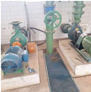
Foto 1 - Dois conjuntos motobomba instalados - EEA 3 (Vila América)
