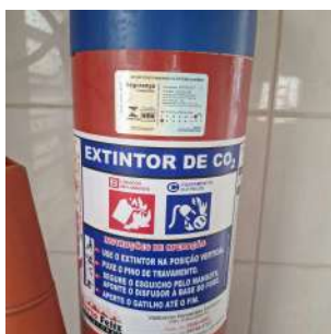
Foto 1 - Extintor de incêndio com validade regular EEA 2 - Justapostas - ETA (Progresso)
