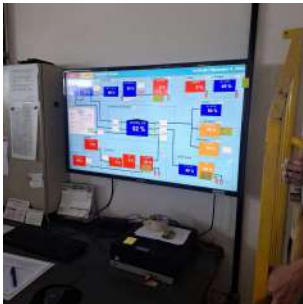
Foto 1 - Centro de controle operacional - ETA
