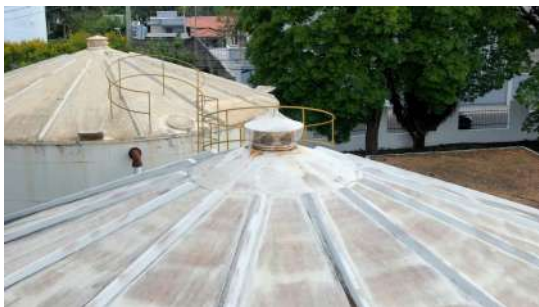
Foto 1 - Tela de proteção - Reservatório Apoiado 17 - CR Popular
