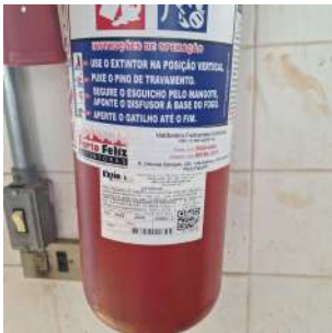
Foto 1 - Extintor com validade regular - EEA 3 (Vila América)
