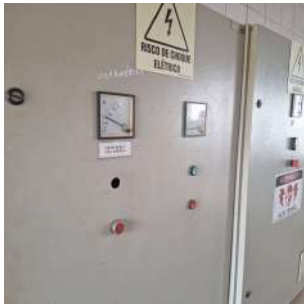
Foto 2 - Painel de comando da EEA 1 Justapostas ETA
