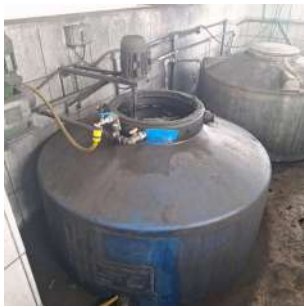
Foto 5 - Preparação - Carvão ativado em pó - ETA
