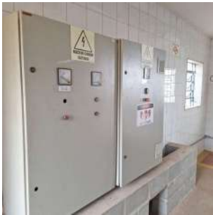
Foto 3 - Painel de comando da EEA 1 Justapostas ETA
