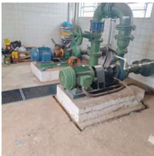
Foto 1 - Dois conjuntos motobomba instalados - EEA 3 (Vila América)
