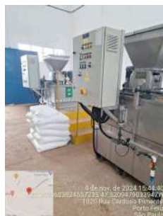
Foto 3 - Sistema de preparação de polímero para condicionamento do lodo
