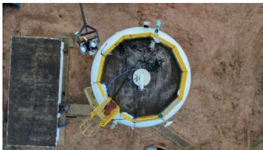
Foto 1 - Presença de ventilação - Reservatório Elevado 35 -Soamin
