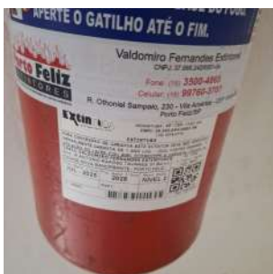
Foto 1 - Extintor com validade regular
