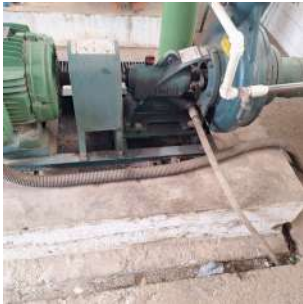
Foto 1 - Encaminhamento adequado da água de lubrificação de gaxetas
