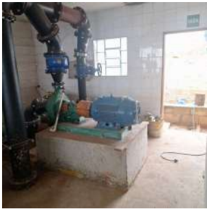
Foto 1 - EEA 1 Justapostas ETA - 8"
