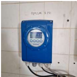
Foto 4 - Macromedidor digital da EEA 4 (São Marcos, Popular)
