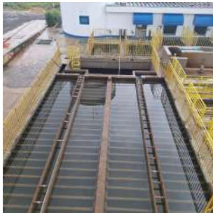
Foto 9 - Decantador visto de cima - ETA
