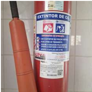
Foto 1 - Extintor de incêndio com validade regular - EEA 1 Justapostas ETA
