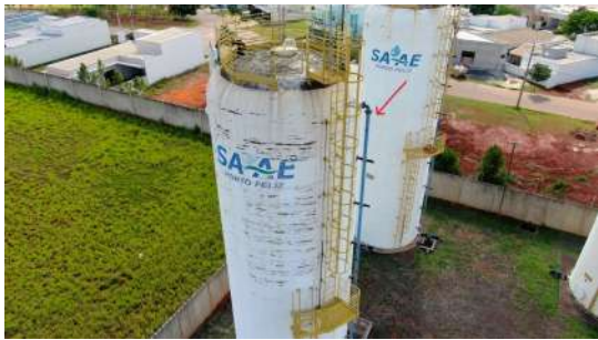
Foto 1 - Extravasor - Reservatório Elevado 31 - Flamboyant
