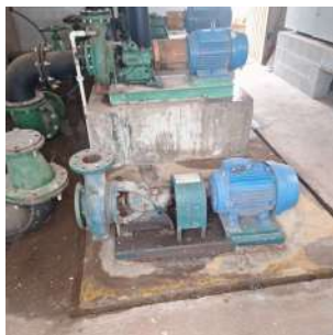
Foto 1 - Conjunto motobomba reserva não instalado - 2 - Justapostas - ETA (Progresso)
