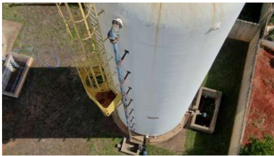
Foto 1 - Extravasor - Reservatório Elevado 34 - Flamboyant
