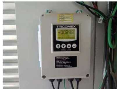
Foto 5 - Medidor de vazão.
