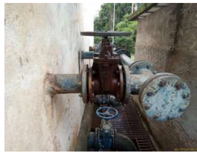
Foto 2 - Vazamento no registro.
