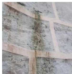
Foto 2 - Detalhe de vazamentos aparentes
