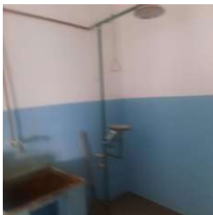
Foto 1 - Chuveiro de emergência.
