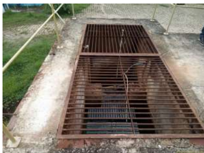
Foto 1 - Ausência tampa de proteção na saída da água tratada.
