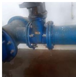
Foto 2 - Vazamento no registro de gaveta .localizado na saída dos filtros
