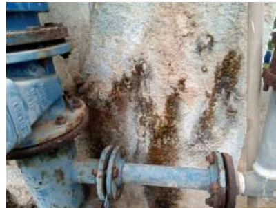
Foto 4 - Vazamentos na parede da ETA 4.
