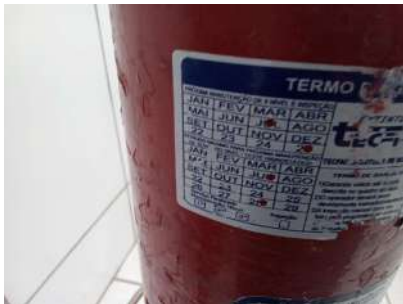
Foto 1 - Validade do extintor.
