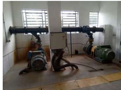
Foto 3 - Conjuntos moto-bombas de recalque para ETA I.
