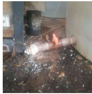
Foto 5 - Vazamento no tanque de armazenamento de PAC em 29.10.24
