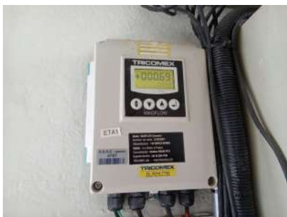
Foto 6 - Medidor de vazão.
