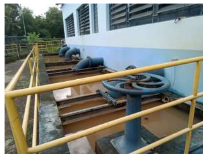
Foto 7 - Poço de sucção.
