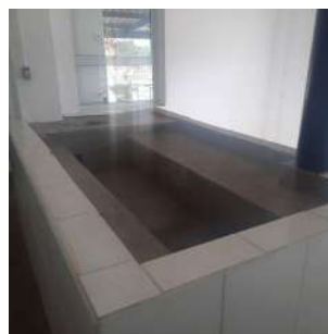
Foto 2 - Bacia de contenção inutilizada
