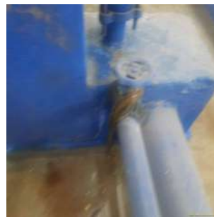
Foto 2 - Vazamento nas tubulações na saída dos filtros.
