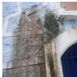
Foto 4 - Detalhe de vazamentos aparentes
