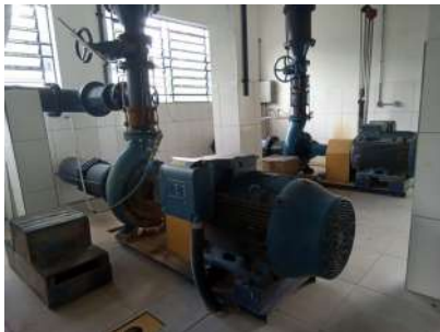
Foto 1 - Conjuntos moto-bombas ETA II. (principal e reserva)
