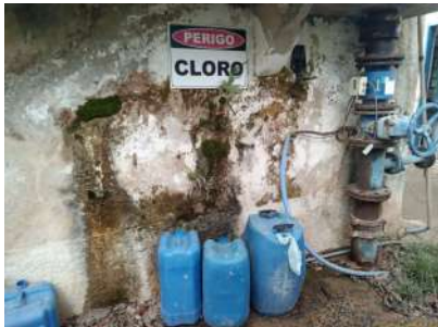
Foto 3 - Vazamentos na parede da ETA 4.
