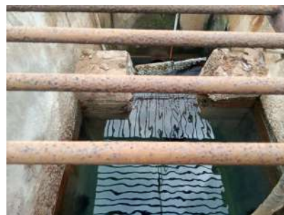
Foto 8 - Saída da água tratada.
