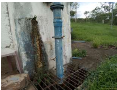
Foto 1 - Vazamentos na parede da ETA 4.
