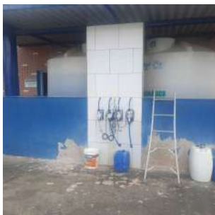
Foto 1 - Produtos químicos com bacia de contenção.
