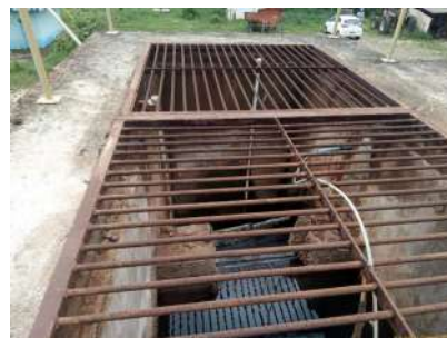
Foto 2 - Ausência tampa de proteção na saída da água tratada.
