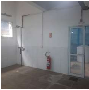
Foto 1 - Chuveiro de emergência.
