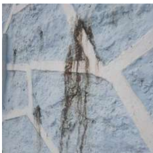
Foto 3 - Detalhe de vazamentos aparentes
