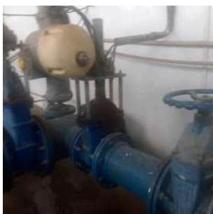
Foto 1 - Vazamento no registro de gaveta. localizado na saída dos filtros
