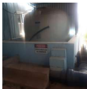
Foto 3 - Tanque de armazenamento de PAC, com bacia de contenção
