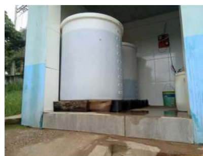
Foto 2 - Ausência de bacia de contenção no armazenamento do PAC.
