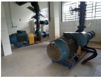
Foto 1 - Conjuntos moto-bombas de recalque para ETA II.
