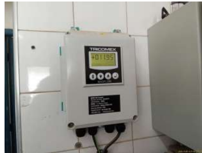
Foto 2 - Display do macromedidor de vazão de saída.
