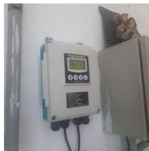
Foto 2 - Display do medidor de vazão na saída da ETA.
