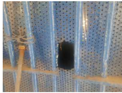
Foto 2 - Aberturas, sem tela de proteção.
