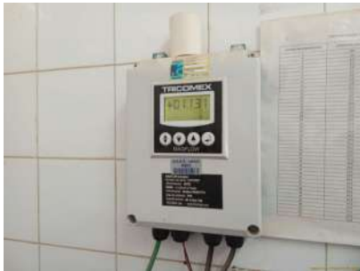
Foto 1 - Display do macromedidor de vazão de entrada.
