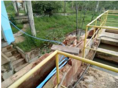
Foto 3 - Chegada da água bruta.
