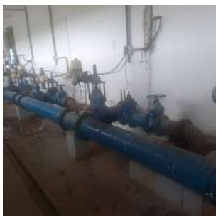
Foto 3 - Vazamento no registro de gaveta. localizado na saída dos filtros
