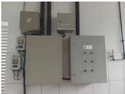
Foto 4 - Quadro de força e medidores de vazão.
