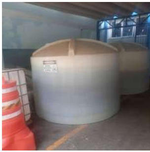
Foto 4 - Ausência de bacia de contenção (hipoclorito de sódio).
