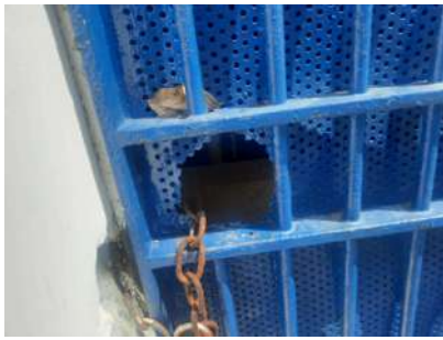
Foto 1 - Aberturas, sem tela de proteção.
