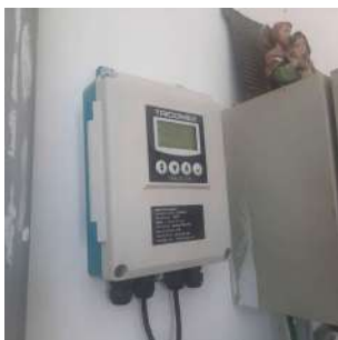
Foto 1 - Display do medidor de vazão na entrada da ETA.
