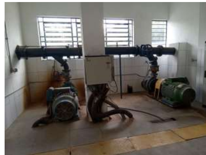
Foto 2 - Conjuntos moto-bombas ETA I. (principal e reserva)
