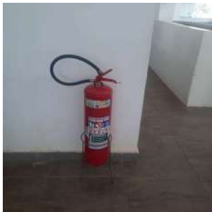
Foto 1 - Extintor de incêndio.
