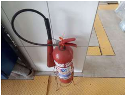
Foto 1 - Extintor de incêndio.
