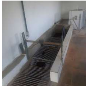
Foto 4 - Chegada da água bruta.
