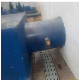
Foto 3 - Vazamento nas tubulações na saída dos filtros.
