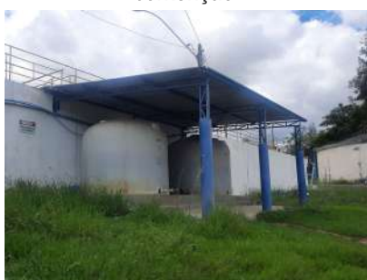
Foto 3 - Ausência de bacia de contenção
