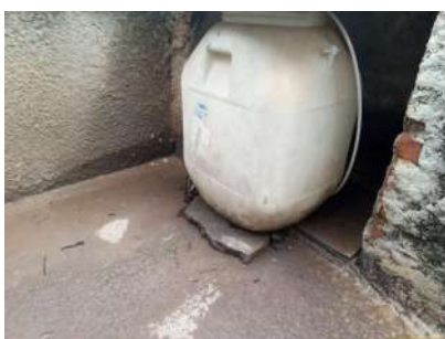
Foto 1 - Ausência de bacia de contenção no armazenamento do flúor.
