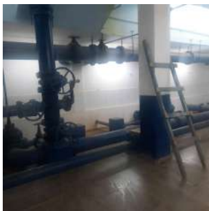
Foto 1 - Vazamento nas tubulações na saída dos filtros.
