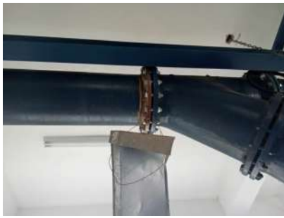
Foto 1 - Detalhe do vazamento na flange com sistema de escoamento improvisado.
