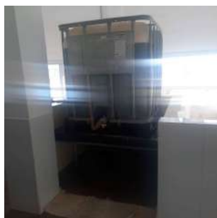
Foto 1 - Ausência de bacia de contenção próximo ao laboratório.
