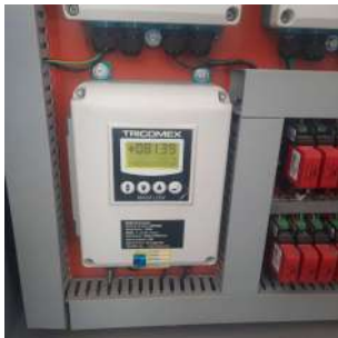
Foto 1 - Display do macromedidor na entrada.
