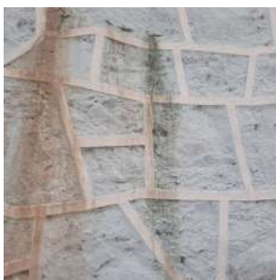
Foto 1 - Detalhe de vazamentos aparentes
