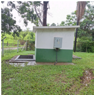
Foto 1 - Visão geral - EEEB Baggio - Casa com poço de Sucção
