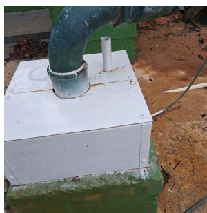
Foto 10 - Tubo medidor de nível - Poço Baggio
