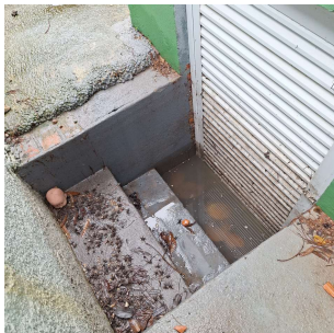
Foto 1 - Acesso ao poço de sucção inundado
