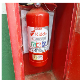
Foto 5 - Extintor de incêndio - EEEB CDH
