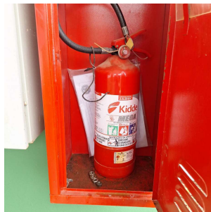
Foto 2 - Extintor de incêndio - EEEB Morada do Sol
