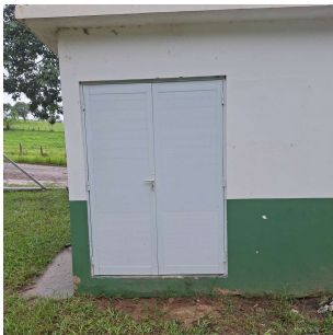
Foto 2 - Porta da Casa com Poço de Sucção - EEEB Baggio
