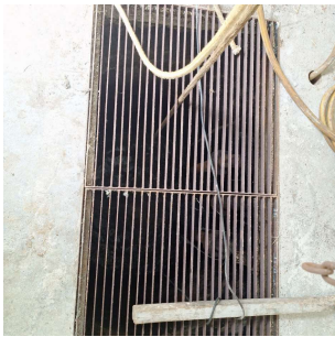
Foto 5 - Poço de Sucção - EEEB Baggio
