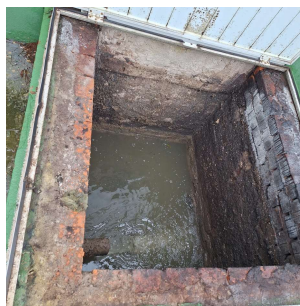
Foto 4 - Chegada de esgoto - EEEB Morada do Sol
