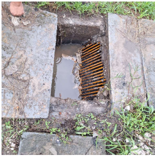
Foto 4 - Gradeamento instalado - EEEB Baggio
