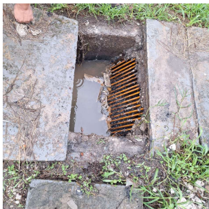
Foto 1 - Gradeamento instalado - EEEB Baggio
