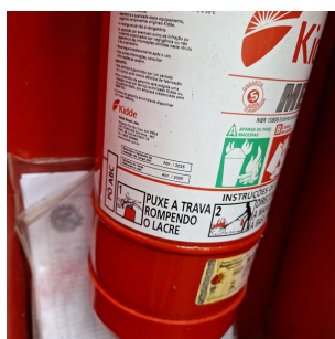
Foto 1 - Extintor de incêndio - validade expirada
