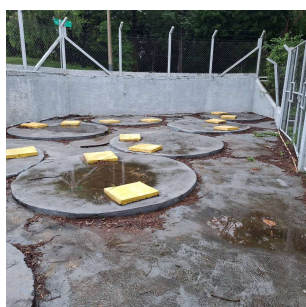
Foto 3 - Sistema fossa filtro anterior ao Poço de Sucção
