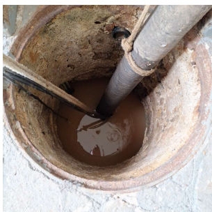
Foto 3 - Poço de sucção - EEEB Pazoto
