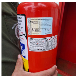
Foto 1 - Extintor de incêndio - validade regular - Poço Baggio
