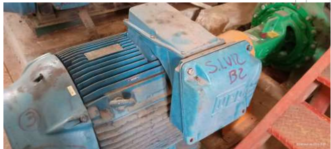
Foto 11 - Conjunto motobomba B2 que recalca para o CR São Luiz.
