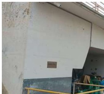
Foto 1 - Vista externa da caixa de chegada de água bruta (vinda das captações do Rio Piracicaba).
