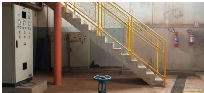
Foto 8 - Escada de acesso ao piso da EEAT 2, painel elétrico e de comando e extintores da EEAT.
