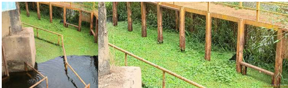
Foto 1 - Situação das estruturas da passarela externa da captação antiga no Rio Piracicaba.
