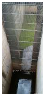
Foto 8 - Vista de um dos 4 poços de entrada de água bruta e gradeamento grosseiro da captação superficial.
