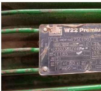
Foto 9 - Placa de especificações técnicas do motor de um dos conjuntos motobomba que recalcam para o reservatório elevado da ETA I.
