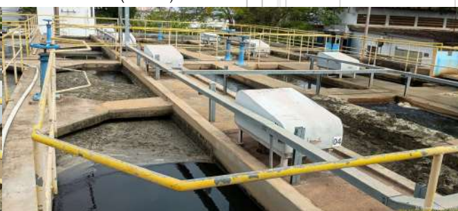
Foto 14 - Floculadores do módulo II (ETA II).
