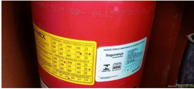
Foto 1 - Extintor de incêndio com validade expirada.
