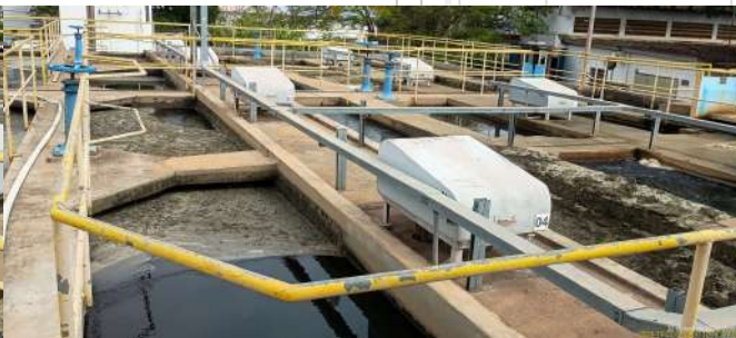
Foto 14 - Floculadores do módulo II (ETA II).
