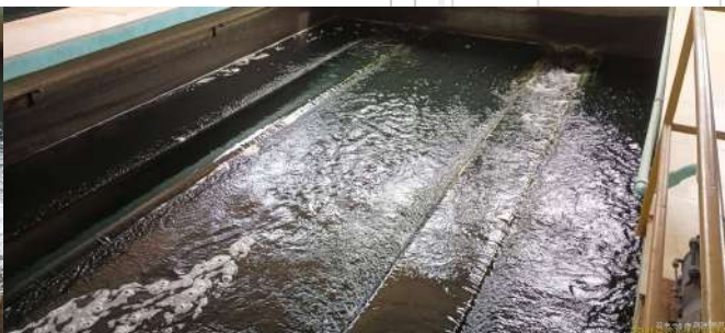
Foto 32 - Filtros do módulo I (ETA I).
