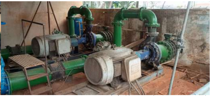
Foto 2 - Conjuntos motobomba em operação da EEAT.
