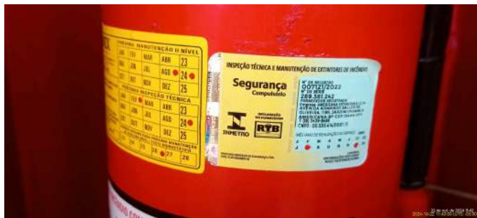
Foto 1 - Validade do extintor expirada.
