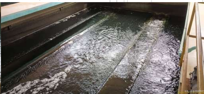
Foto 32 - Filtros do módulo I (ETA I).
