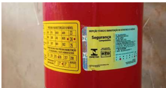
Foto 1 - Extintor com prazos de manutenção vencidos.
