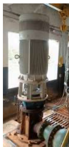
Foto 7 - Segundo conjunto motobomba.
