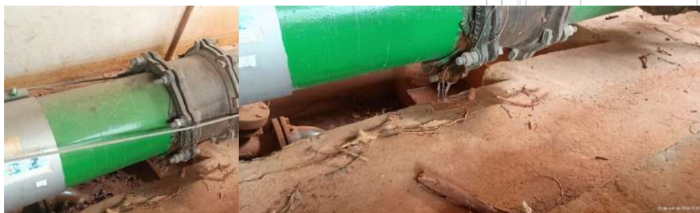
Foto 1 - Trecho da adutora com vazamento.
