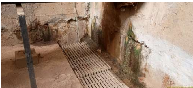
Foto 7 - Pontos de infiltração na parede e próximo ao piso do poço seco.
