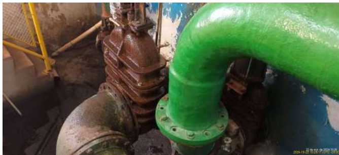
Foto 8 - Vazamento em registro de tubulação abaixo dos filtros da ETA 1.
