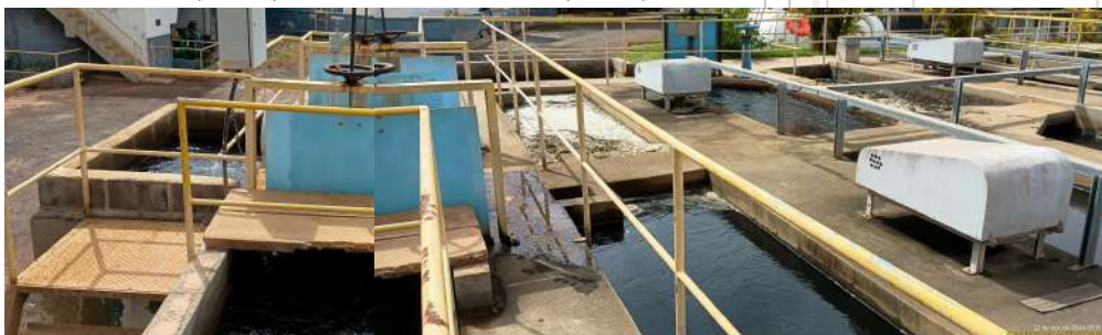
Foto 11 - Chegada da água bruta no módulo II.
