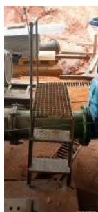
Foto 1 - Escada utilizada para acesso entre as tubulações.
