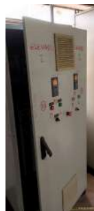
Foto 9 - Painel elétrico e de comando da EEAT 2.
