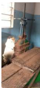
Foto 1 - Vazamento no registro da tubulação de adução.
