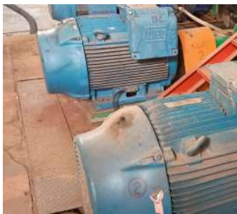
Foto 13 - Conjunto motobomba B1 de recalque para o CR São Luiz.
