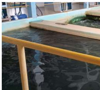
Foto 21 - Filtros do módulo II (ETA II).
