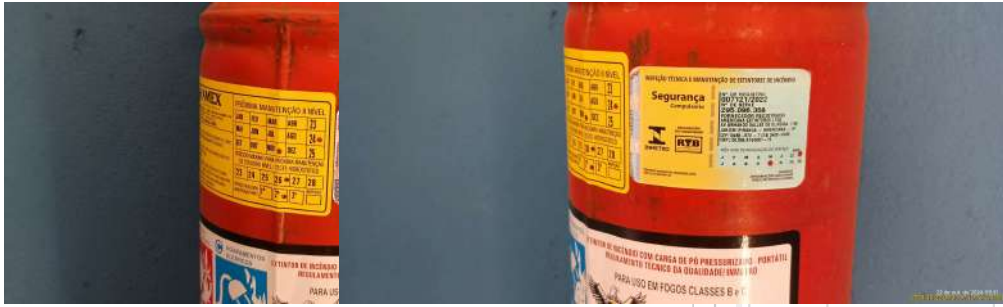
Foto 5 - Extintor de incêndio com prazo vencido. Foto 6 - Extintor de incêndio com prazo vencido.
