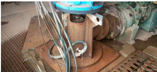
Foto 2 - Drenagem inadequada da água de lubrificação de gaxetas do conjunto motobomba 3.
