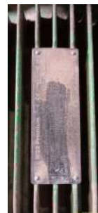
Foto 7 - Placa de especificações técnicas do motor de um dos conjuntos motobomba que recalcam para o reservatório elevado ETA 2.
