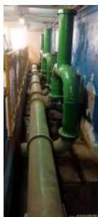
Foto 6 - Local abaixo dos filtros da ETA 1.
