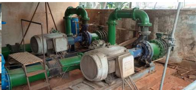
Foto 2 - Conjuntos motobomba em operação da EEAT.
