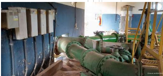
Foto 11 - Barrilete de recalque.
