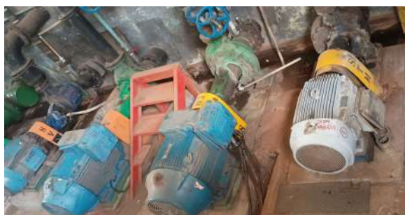
Foto 5 - Vista geral dos conjuntos motobomba da parte interna da EEAT.
