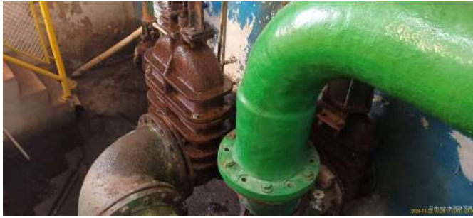
Foto 8 - Vazamento em registro de tubulação abaixo dos filtros da ETA 1.
