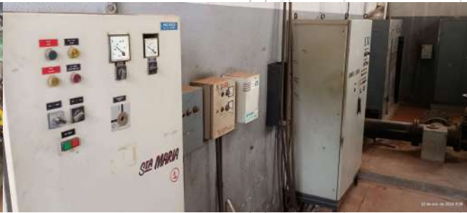
Foto 6 - Painéis elétricos e de comando situados na parte interna da EEAT.
