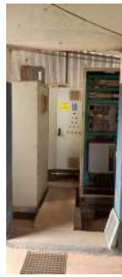
Foto 12 - Painéis elétricos e de comando dos conjuntos motobomba.
