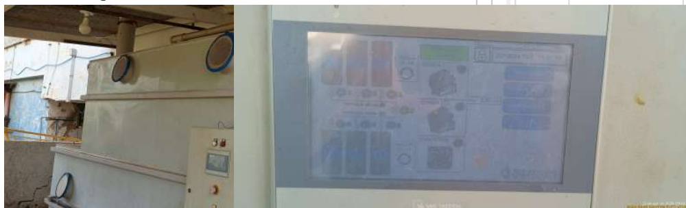
Foto 42 - Sistema de limpeza e exaustão do cloro gás em casos de vazamentos.
