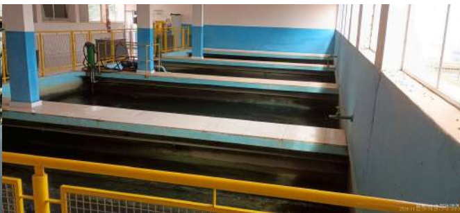
Foto 30 - Filtros do módulo I (ETA I).
