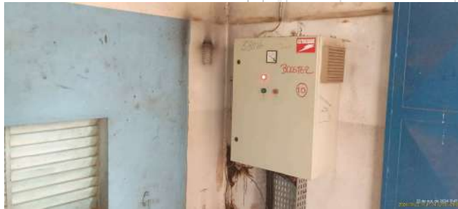
Foto 4 - Pannel elétrico do booster.
