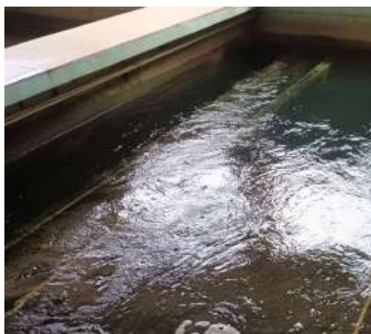
Foto 31 - Filtros do módulo I (ETA I).
