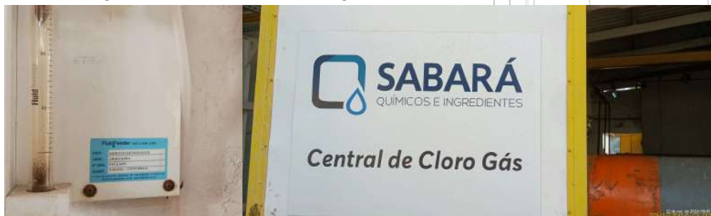
Foto 40 - Dosagem de cloro gás.
