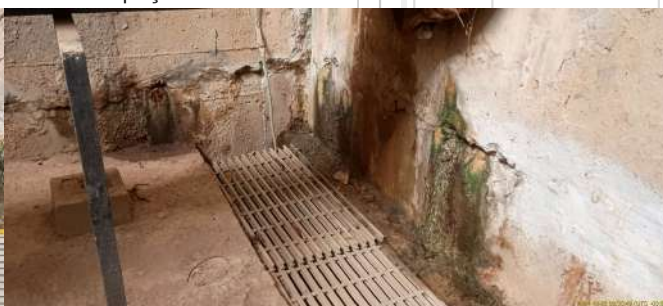
Foto 7 - Pontos de infiltração na parede e próximo ao piso do poço seco.
