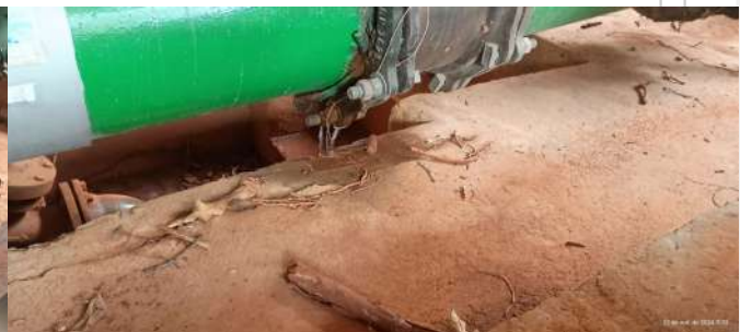
Foto 2 - Detalhe do vazamento.
