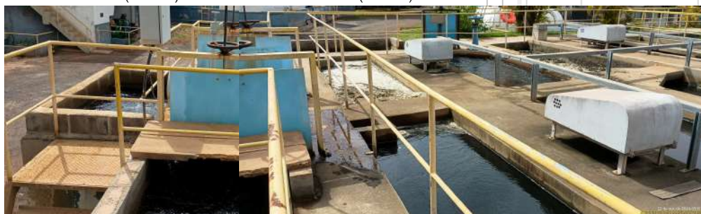
Foto 11 - Chegada da água bruta no módulo II.
