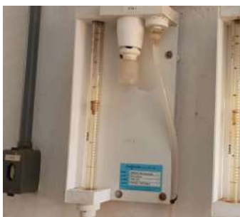
Foto 38 - Dosagem de cloro gás.
