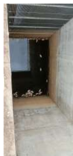
Foto 9 - Vista de um dos 4 poços de entrada de água bruta e gradeamento grosseiro da captação superficial.
