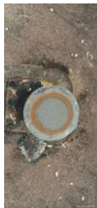
Foto 1 - Tela de proteção na tubulação de ventilação.
