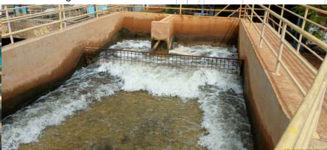
Foto 8 - Divisão da vazão para direcionamento aos módulos I e II.
