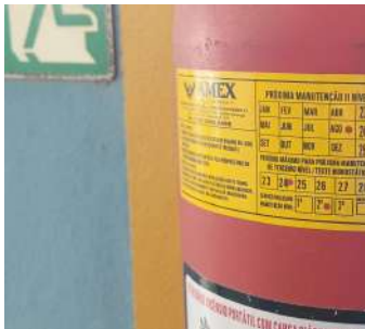
Foto 1 - Extintor de incêndio com prazo vencido.
