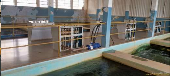
Foto 22 - Filtros do módulo II (ETA II).
