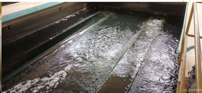
Foto 32 - Filtros do módulo I (ETA I).
