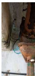
Foto 3 - Vazamento embaixo do filtro da ETA 1.
