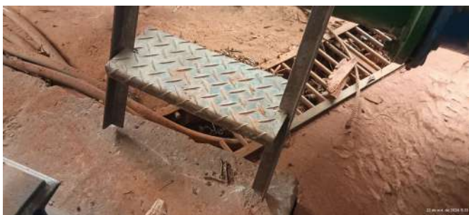
Foto 2 - Detalhe dos pés da escada e seu desnivelamento em relação ao piso.
