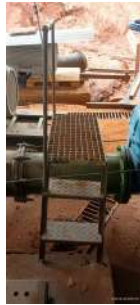
Foto 1 - Escada utilizada para acesso entre as tubulações.
