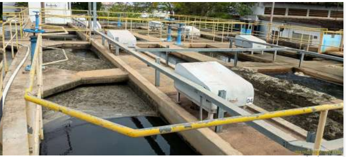
Foto 14 - Floculadores do módulo II (ETA II).
