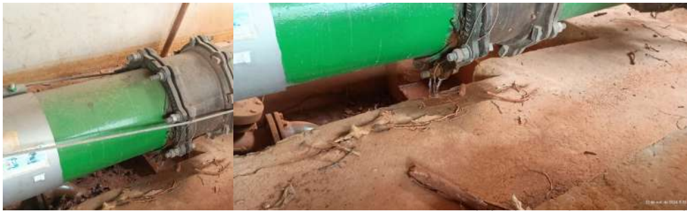
Foto 1 - Trecho da adutora com vazamento.
