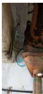
Foto 3 - Vazamento embaixo do filtro da ETA 1.
