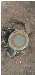
Foto 1 - Tela de proteção na tubulação de ventilação.
