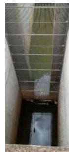
Foto 6 - Vista de um dos 4 poços de entrada de água bruta e gradeamento grosseiro da captação superficial.
