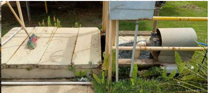
Foto 24 - Chegada da água bruta no módulo I (ETA I).
