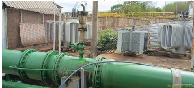
Foto 4 - Vazamento na ventosa da adutora de recalque.
