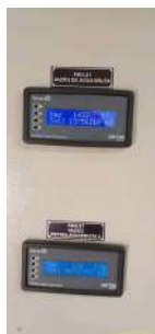
Foto 46 - Painel de acompanhamento de vazões na ETA.
