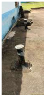
Foto 1 - Tubos de ventilação do reservatório.
