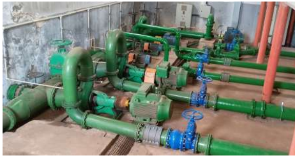
Foto 1 - Vista geral dos conjuntos motobomba da EEAT 2 da ETA.
