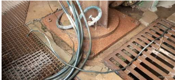
Foto 3 - Drenagem inadequada da água de lubrificação de gaxetas do conjunto motobomba 3.
