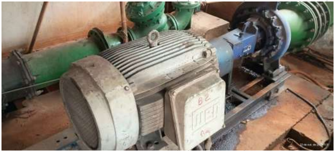
Foto 4 - Um dos conjuntos motobomba em operação.
