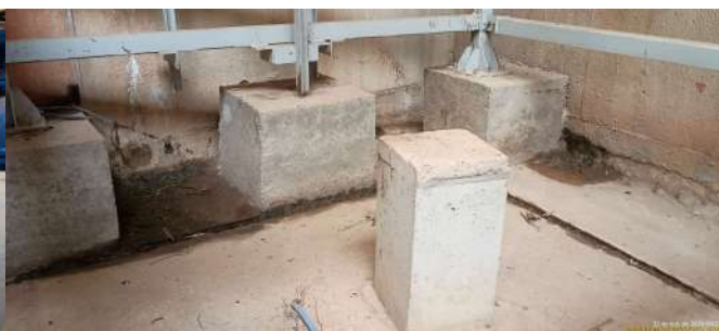
Foto 4 - Pontos de infiltração próximo ao piso do poço seco.
