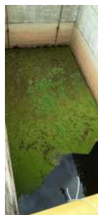
Foto 10 - Um dos 2 tanques pós-gradeamento e caixa de areia.
