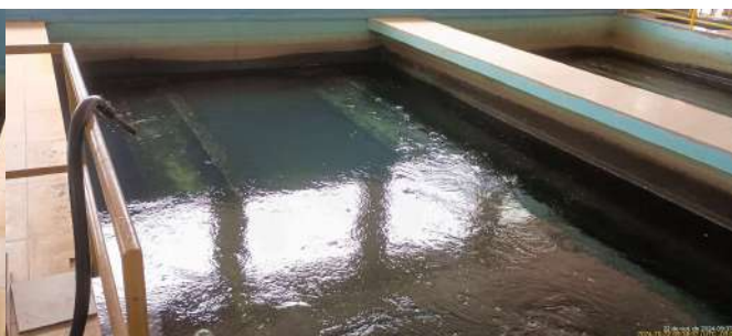
Foto 34 - Filtros do módulo I (ETA I).
