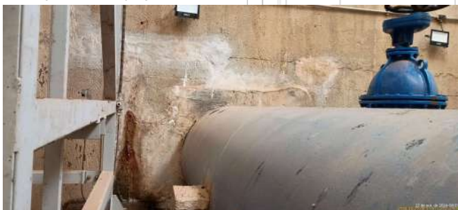
Foto 3 - Pontos de infiltração na parede do poço seco.
