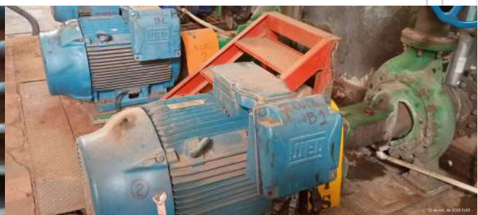
Foto 13 - Conjunto motobomba B1 de recalque para o CR São Luiz.
