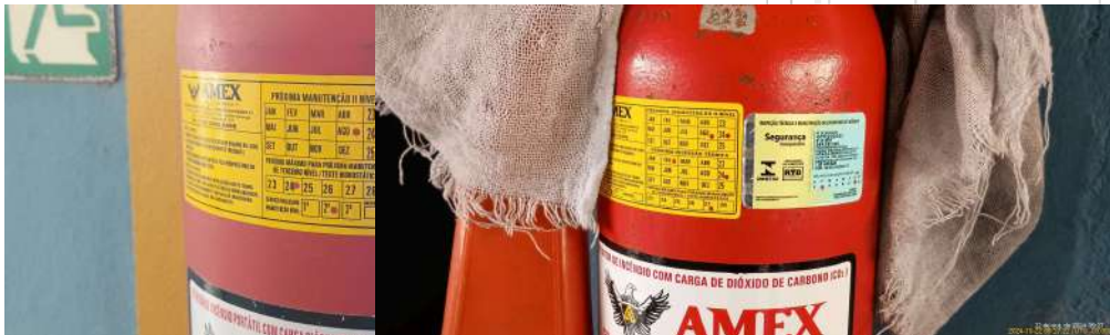
Foto 1 - Extintor de incêndio com prazo vencido.
