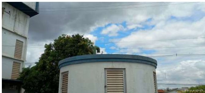
Foto 1 - Tubulação de ventilação do reservatório.
