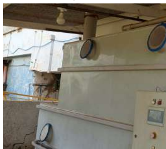
Foto 42 - Sistema de limpeza e exaustão do cloro
