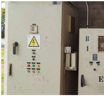
Foto 3 - Painéis elétricos e de comando da EEAT.
