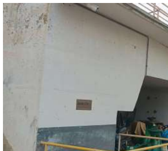
Foto 1 - Vista externa da caixa de chegada de água bruta (vinda das captações do Rio Piracicaba).
