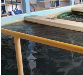
Foto 21 - Filtros do módulo II (ETA II).
