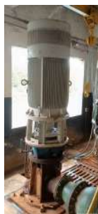
Foto 7 - Segundo conjunto motobomba.
