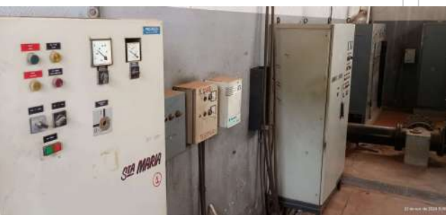
Foto 6 - Painéis elétricos e de comando situados na parte interna da EEAT.
