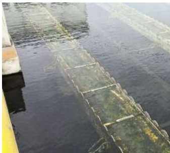
Foto 17 - Decantadores do módulo II (ETA II).
