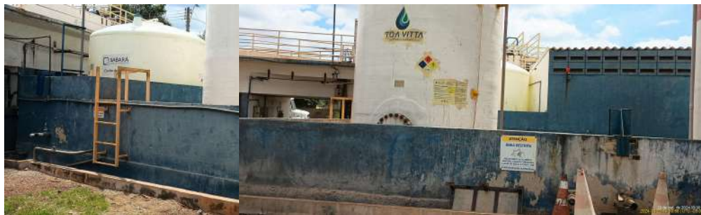
Foto 1 - Bacia de contenção e identificação do tanque de clorito de sódio.
