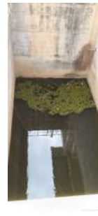
Foto 12 - Poço de sucção para bombeamento.
