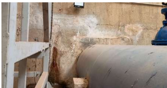
Foto 3 - Pontos de infiltração na parede do poço seco.
