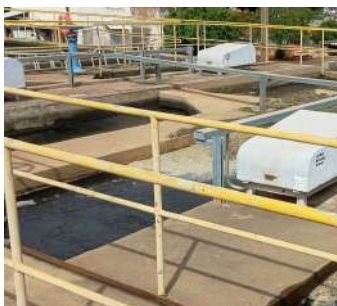
Foto 13 - Floculadores do módulo II (ETA II).
