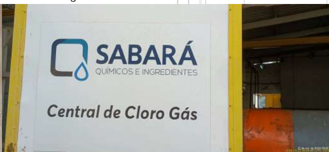
Foto 41 - Identificação da Central de Cloro gás na ETA.
