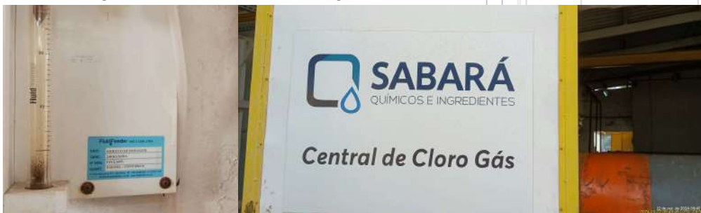
Foto 40 - Dosagem de cloro gás.
