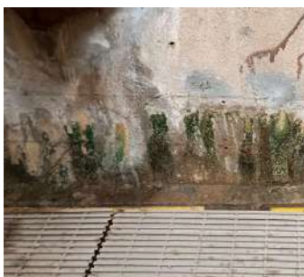
Foto 6 - Pontos de infiltração na parede e próximo ao piso do poço seco.
