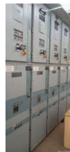
Foto 19 - Vista interna da sala de comandos elétricos.
