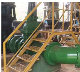
Foto 4 - Vista interna dos conjuntos motobomba (2+1R) da antiga captação.
