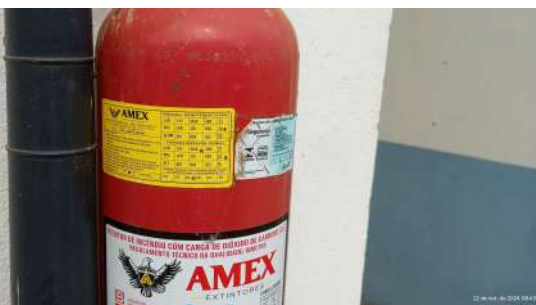
Foto 4 - Data de vencimento de um dos extintores de incêndio.
