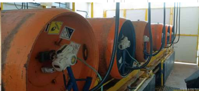
Foto 39 - Tanques de cloro gás.
