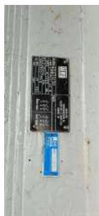
Foto 8 - Placa de especificações técnicas do motor de um dos conjuntos motobomba.
