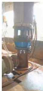
Foto 3 - Vazamento excessivo da água de
