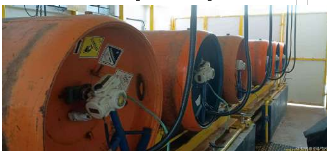
Foto 39 - Tanques de cloro gás.
