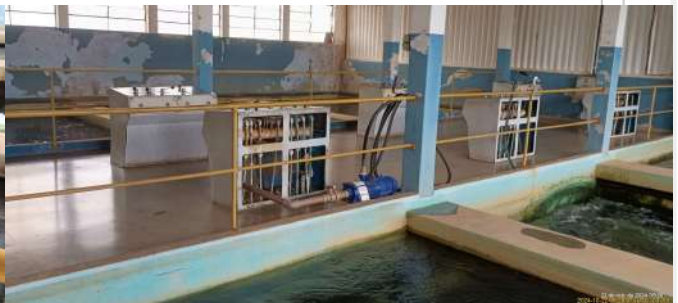
Foto 22 - Filtros do módulo II (ETA II).
