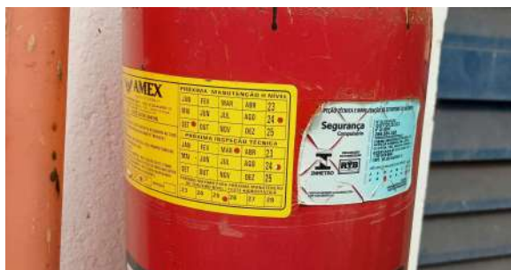
Foto 3 - Data de vencimento de um dos extintores de incêndio.
