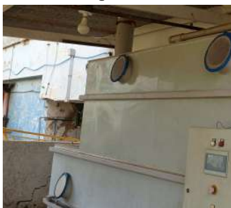
Foto 42 - Sistema de limpeza e exaustão do cloro gás em casos de vazamentos.
