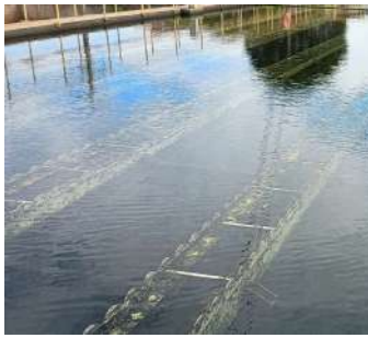
Foto 19 - Decantadores do módulo II (ETA II).
