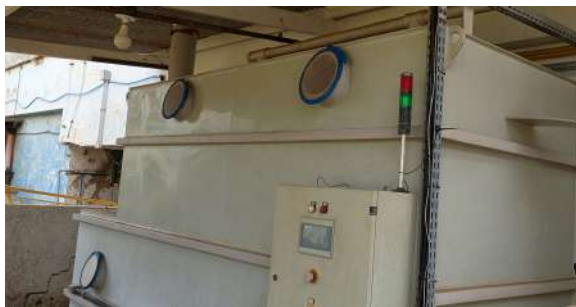
Foto 42 - Sistema de limpeza e exaustão do cloro gás em casos de vazamentos.
