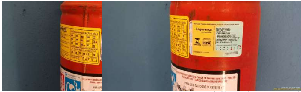
Foto 5 - Extintor de incêndio com prazo vencido. Foto 6 - Extintor de incêndio com prazo vencido.
