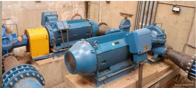
Foto 15 - Vista de dois dos quatro conjuntos motobomba de recalque de água bruta.
