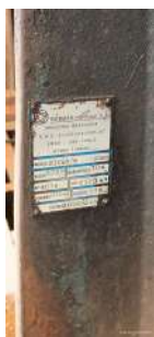
Foto 9 - Placa de especificações técnicas da bomba de um dos conjuntos motobomba.
