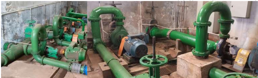
Foto 1 - Vista geral dos conjuntos motobomba da EEAT 2 da ETA.
