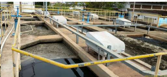
Foto 14 - Floculadores do módulo II (ETA II).
