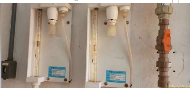
Foto 38 - Dosagem de cloro gás.
