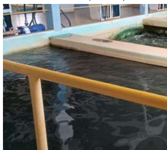
Foto 21 - Filtros do módulo II (ETA II).
