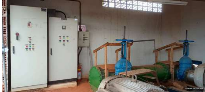
Foto 5 - Painéis elétricos e de comando da EEAT.
