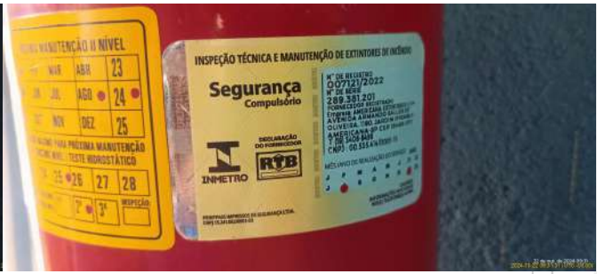
Foto 4 - Extintor de incêndio com prazo vencido.
