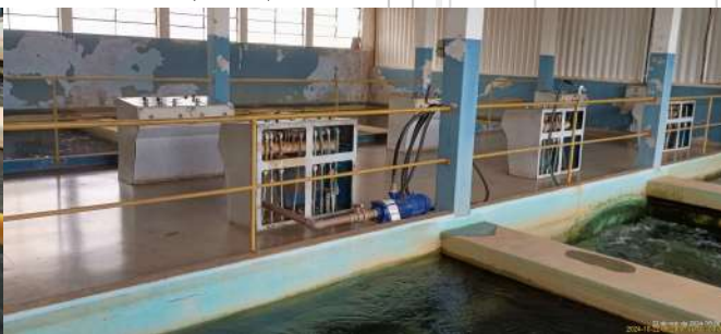
Foto 22 - Filtros do módulo II (ETA II).
