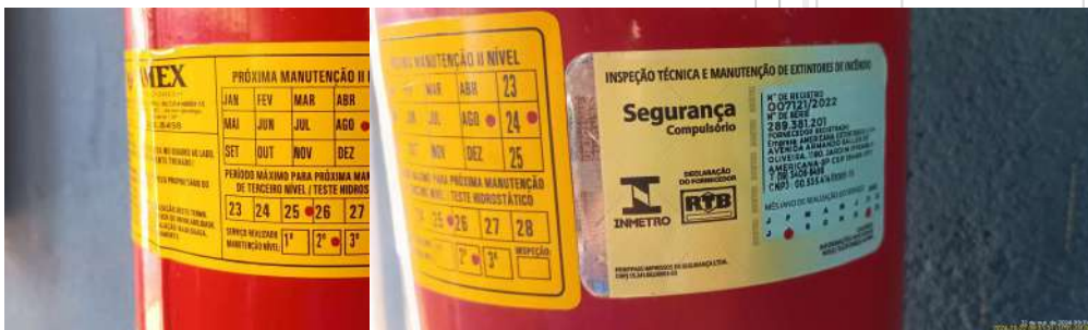
Foto 3 - Extintor de incêndio com prazo vencido.
