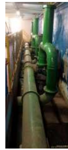
Foto 6 - Local abaixo dos filtros da ETA 1.
