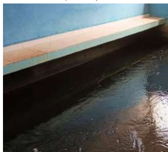
Foto 33 - Filtros do módulo I (ETA I).
