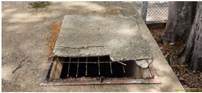
Foto 3 - Tampa de concreto quebrada.
