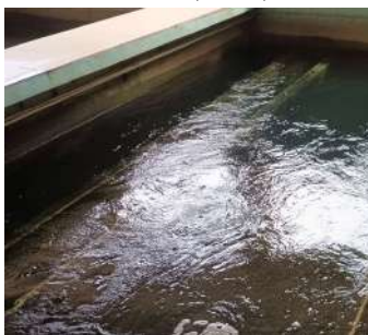
Foto 31 - Filtros do módulo I (ETA I).
