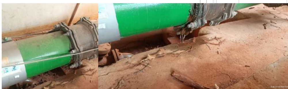
Foto 1 - Trecho da adutora com vazamento.
