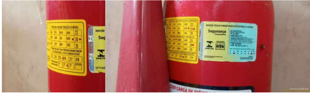
Foto 1 - Extintor com prazos de manutenção vencidos. Foto 2 - Extintor com prazos de manutenção vencidos.
