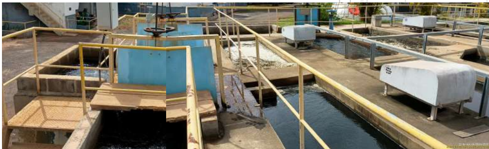
Foto 11 - Chegada da água bruta no módulo II.
