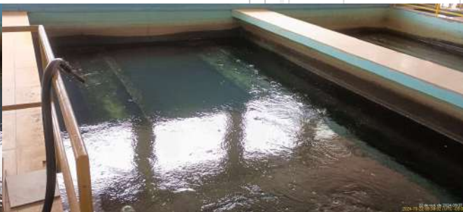
Foto 34 - Filtros do módulo I (ETA I).
