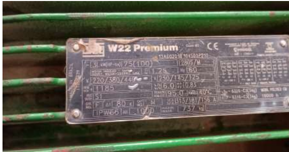
Foto 9 - Placa de especificações técnicas do motor de um dos conjuntos motobomba que recalcam para o reservatório elevado da ETA I.
