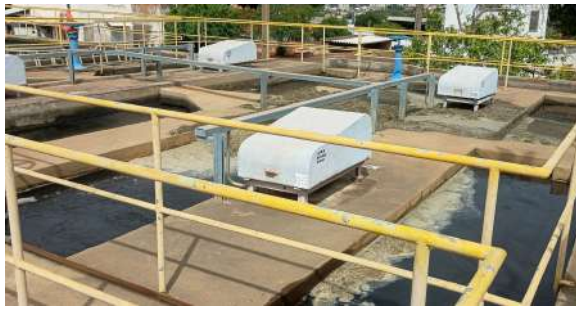
Foto 13 - Floculadores do módulo II (ETA II).
