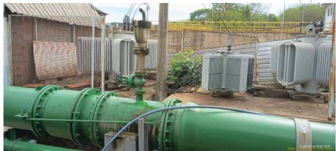
Foto 4 - Vazamento na ventosa da adutora de recalque.
