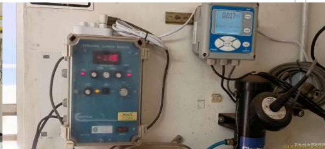
Foto 45 - Painéis de acompanhamento e controle de parâmetros da qualidade da água.
