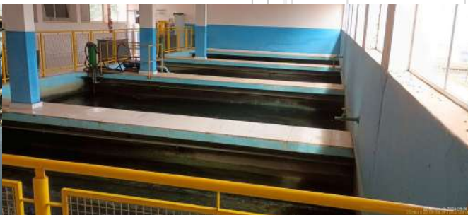
Foto 30 - Filtros do módulo I (ETA I).
