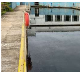
Foto 15 - Decantadores do módulo II (ETA II).
