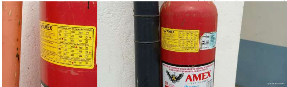
Foto 3 - Data de vencimento de um dos extintores de incêndio.
