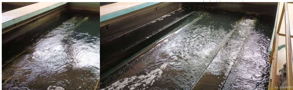
Foto 31 - Filtros do módulo I (ETA I).
