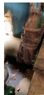
Foto 2 - Detalhe do vazamento no registro.
