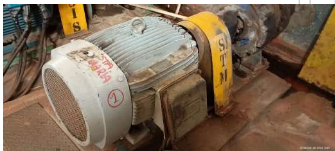
Foto 14 - Um dos conjuntos motobomba que recalcam para o CR Santa Maria.
