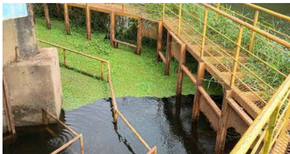
Foto 1 - Situação das estruturas da passarela externa da captação antiga no Rio Piracicaba.
