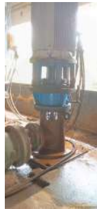
Foto 3 - Vazamento excessivo da água de lubrificação de gaxeta no conjunto motobomba 3. Detalhe para o piso molhado da elevatória.
