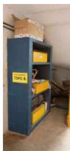
Foto 35 - Equipamentos de emergência do sistema de cloro gás.
