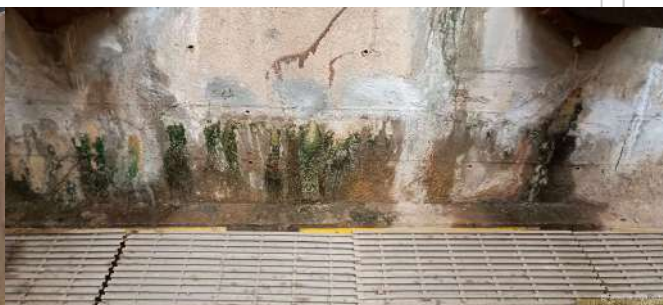
Foto 6 - Pontos de infiltração na parede e próximo ao piso do poço seco.
