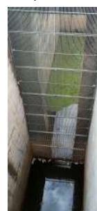
Foto 8 - Vista de um dos 4 poços de entrada de água bruta e gradeamento grosseiro da captação superficial.
