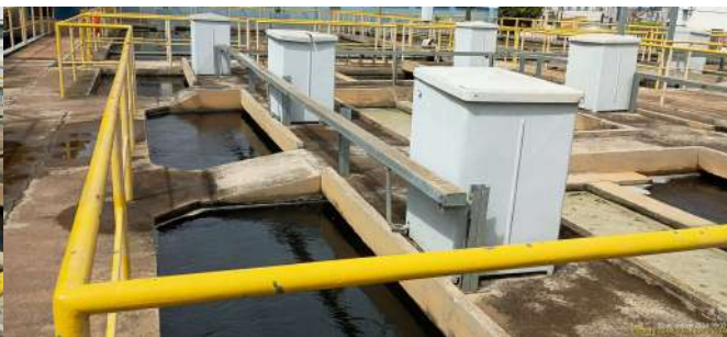
Foto 26 - Floculadores do módulo I (ETA I).
