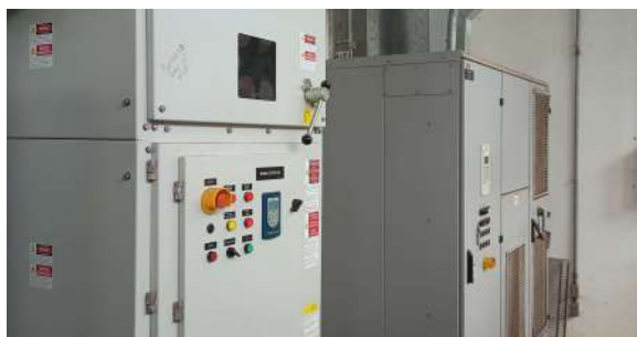
Foto 20 - Vista interna da sala de comandos elétricos.
