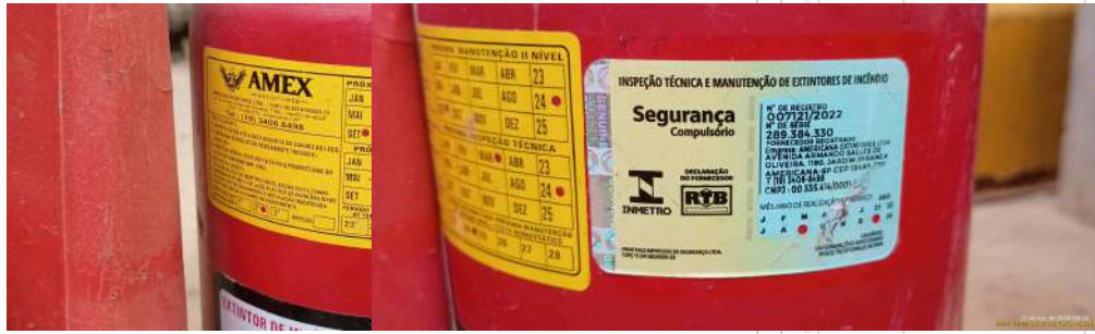
Foto 1 - Data de vencimento de um dos extintores de incêndio.
