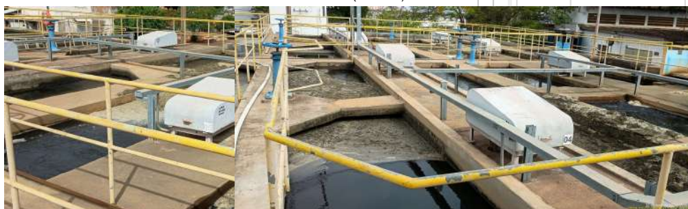
Foto 13 - Floculadores do módulo II (ETA II).
