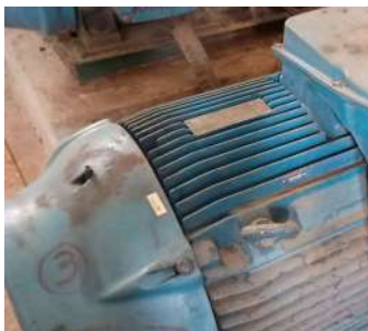
Foto 11 - Conjunto motobomba B2 que recalca para o CR São Luiz.
