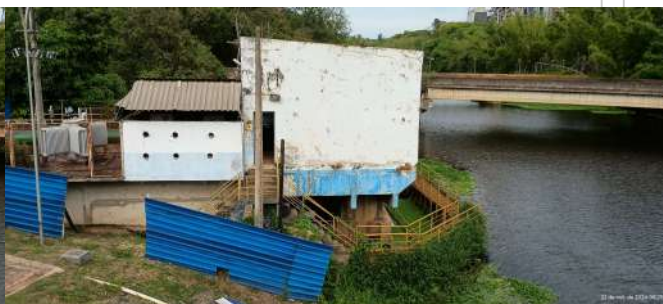
Foto 2 - Captação superficial 2 (antiga) do Rio Piracicaba.
