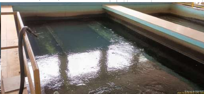
Foto 34 - Filtros do módulo I (ETA I).
