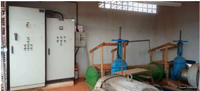
Foto 5 - Painéis elétricos e de comando da EEAT.
