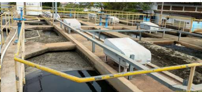
Foto 14 - Floculadores do módulo II (ETA II).
