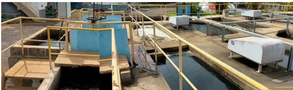
Foto 11 - Chegada da água bruta no módulo II.
