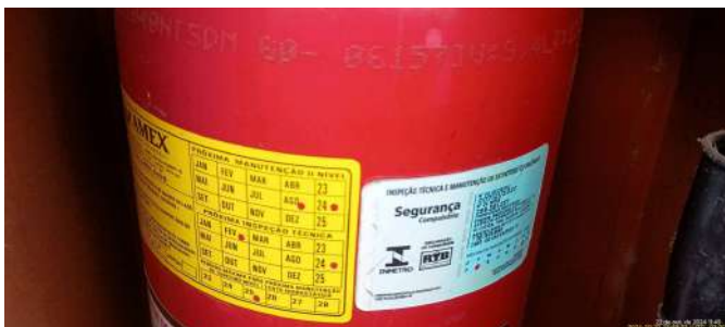
Foto 1 - Extintor de incêndio com validade expirada.
