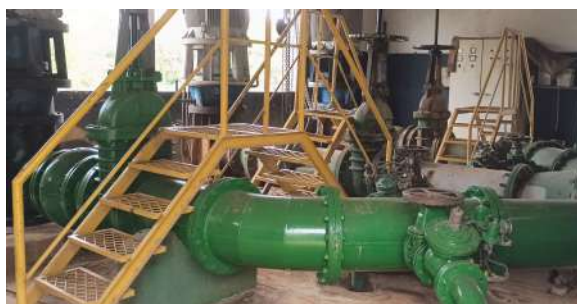
Foto 4 - Vista interna dos conjuntos motobomba (2+1R) da antiga captação.
