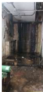
Foto 1 - Vazamentos na alvenaria da transição entre decantador e filtro da ETA 2
