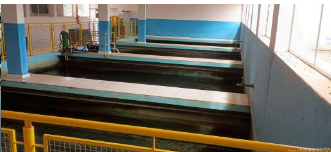
Foto 30 - Filtros do módulo I (ETA I).
