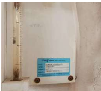
Foto 40 - Dosagem de cloro gás.
