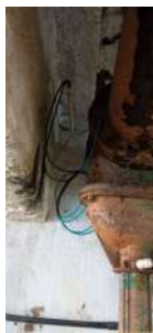
Foto 3 - Vazamento embaixo do filtro da ETA 1.
