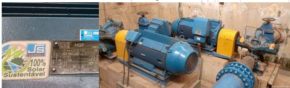
Foto 16 - Placa de especificações técnicas de um dos conjuntos motobomba de recalque.
