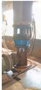
Foto 3 - Vazamento excessivo da água de lubrificação de gaxeta no conjunto motobomba 3. Detalhe para o piso molhado da elevatória.
