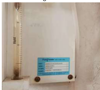
Foto 40 - Dosagem de cloro gás.
