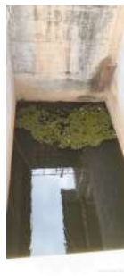
Foto 12 - Poço de sucção para bombeamento.
