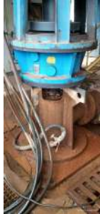
Foto 1 - Vazamento excessivo da água de lubrificação de gaxeta no conjunto motobomba 3.
