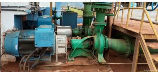
Foto 16 - Vista do conjuntos motobomba situados do lado externo, que recalcam para o CR Jd. Brasil
