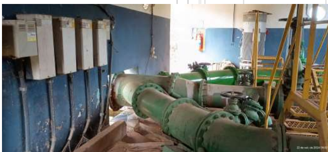
Foto 11 - Barrilete de recalque.
