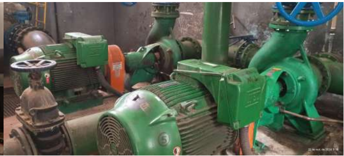
Foto 8 - Conjuntos motobomba que recalcam para o reservatório elevado ETA I.
