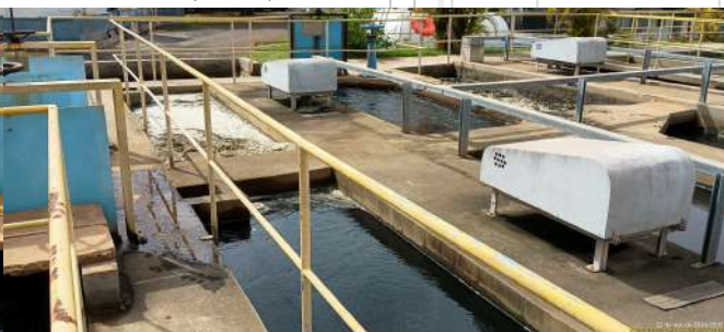
Foto 12 - Floculadores do módulo II (ETA II).
