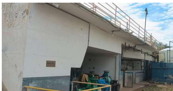
Foto 1 - Vista externa da caixa de chegada de água bruta (vinda das captações do Rio Piracicaba).
