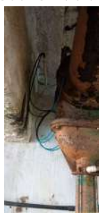
Foto 3 - Vazamento embaixo do filtro da ETA 1.
