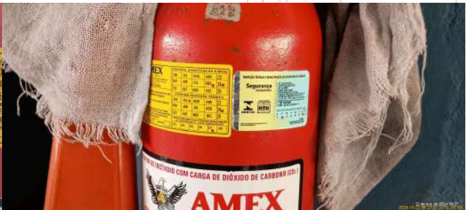
Foto 2 - Extintor de incêndio com prazo vencido.
