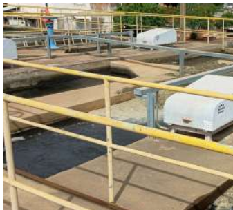
Foto 13 - Floculadores do módulo II (ETA II).
