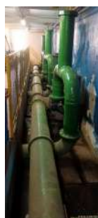
Foto 6 - Local abaixo dos filtros da ETA 1.
