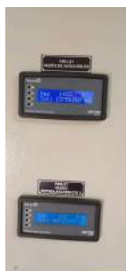
Foto 46 - Painel de acompanhamento de vazões na ETA.
