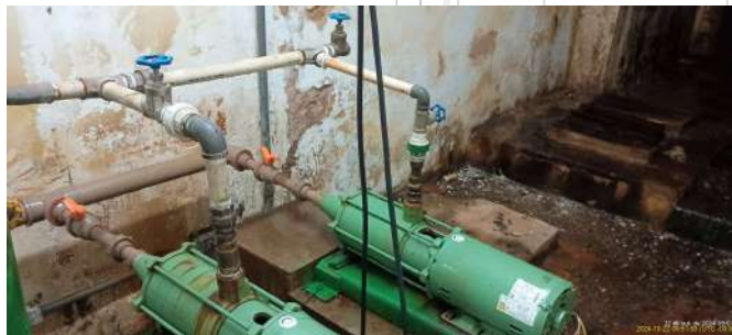
Foto 2 - Vazamento nas bombas de retro lavagem da ETA 2
