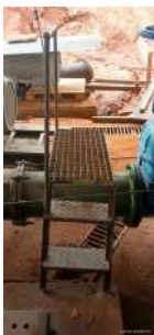
Foto 1 - Escada utilizada para acesso entre as tubulações.
