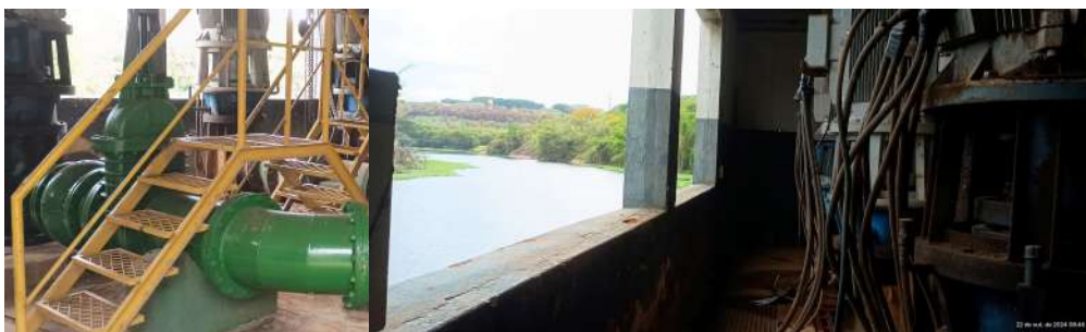
Foto 4 - Vista interna dos conjuntos motobomba (2+1R) da antiga captação.
