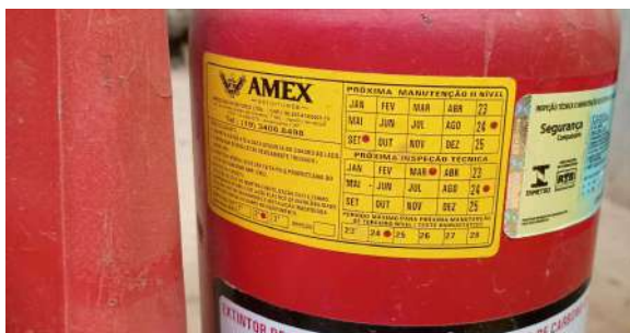
Foto 1 - Data de vencimento de um dos extintores de incêndio.
