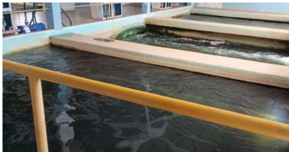
Foto 21 - Filtros do módulo II (ETA II).
