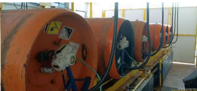
Foto 39 - Tanques de cloro gás.
