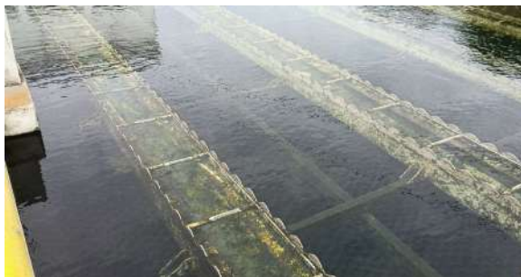
Foto 17 - Decantadores do módulo II (ETA II).
