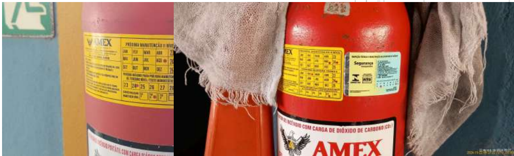
Foto 1 - Extintor de incêndio com prazo vencido.
