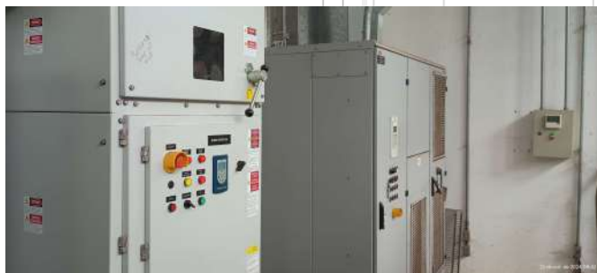
Foto 20 - Vista interna da sala de comandos elétricos.
