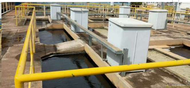
Foto 26 - Flocculadores do módulo I (ETA I).
