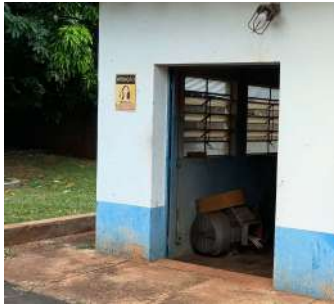
Foto 1 - Casa de bomba do booster.
