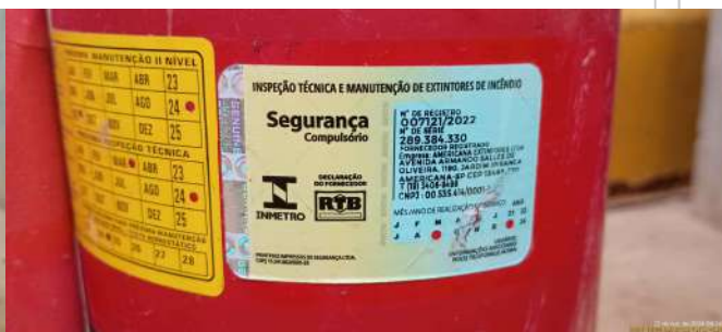
Foto 2 - Data de vencimento de um dos extintores de incêndio.
