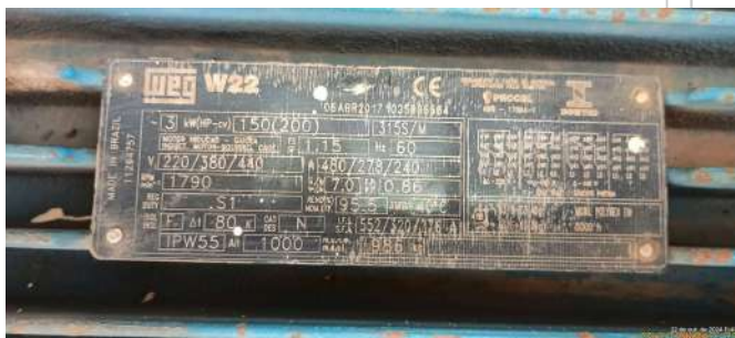
Foto 17 - Placa de especificações técnicas do motor de um dos conjuntos motobomba que recalcam para o CR Jd. Brasil.
