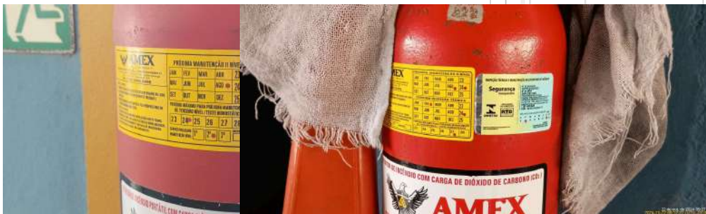
Foto 1 - Extintor de incêndio com prazo vencido.
