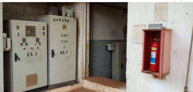
Foto 2 - Painéis elétricos e de comando da EEAT, além do extintor de incêndio na entrada do local.
