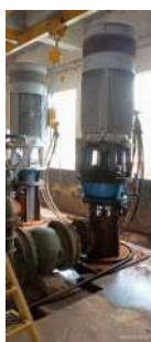
Foto 10 - Terceiro conjunto motobomba.
