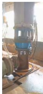
Foto 3 - Vazamento excessivo da água de lubrificação de gaxeta no conjunto motobomba 3. Detalhe para o piso molhado da elevatória.
