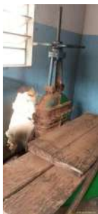
Foto 1 - Vazamento no registro da tubulação de adução.
