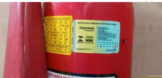
Foto 2 - Extintor com prazos de manutenção vencidos.
