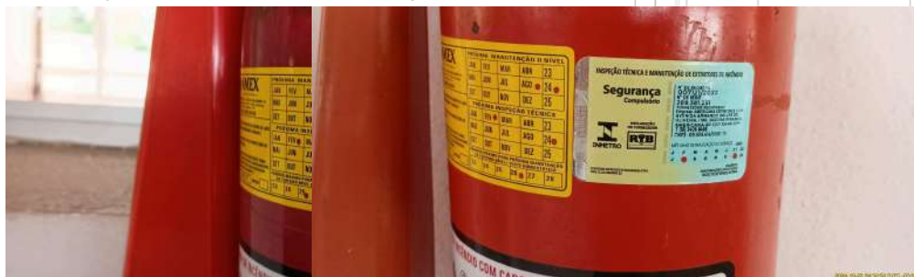
Foto 7 - Extintor de incêndio com prazo vencido. Foto 8 - Extintor de incêndio com prazo vencido.
