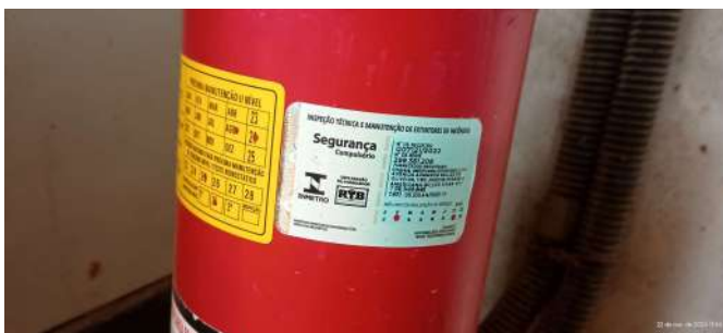
Foto 1 - Prazo para manutenção do extintor vencido.
