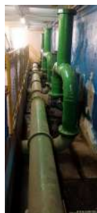
Foto 6 - Local abaixo dos filtros da ETA 1.
