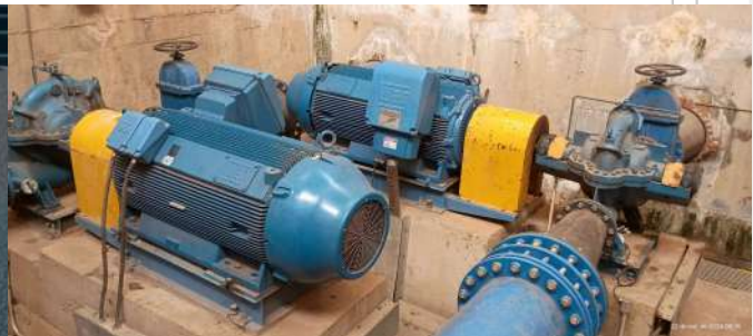
Foto 17 - Vista de outros 2 conjuntos motobomba de recalque.
