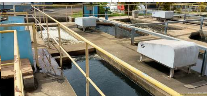
Foto 12 - Floculadores do módulo II (ETA II).
