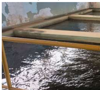
Foto 23 - Filtros do módulo II (ETA II).
