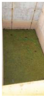
Foto 11 - Um dos 2 tanques pós-gradamento e caixa de areia.
