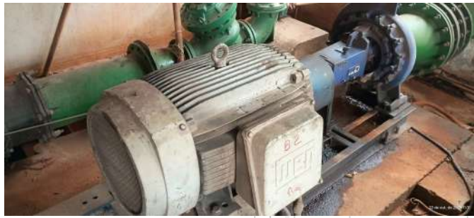
Foto 4 - Um dos conjuntos motobomba em operação.
