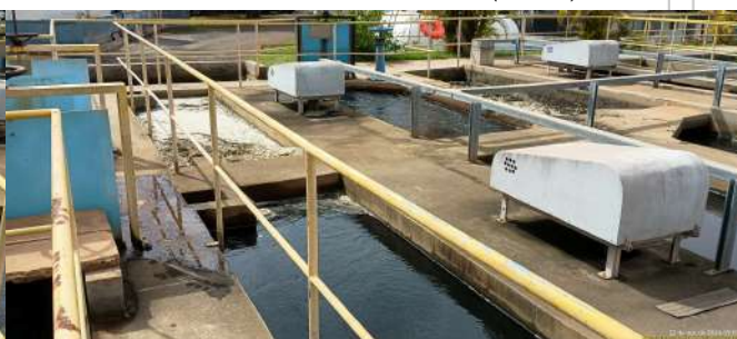
Foto 12 - Flocculadores do módulo II (ETA II).
