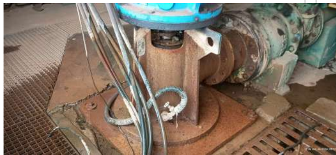
Foto 2 - Drenagem inadequada da água de lubrificação de gaxetas do conjunto motobomba 3.
