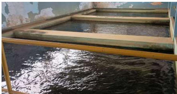
Foto 23 - Filtros do módulo II (ETA II).
