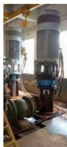
Foto 10 - Terceiro conjunto motobomba.
