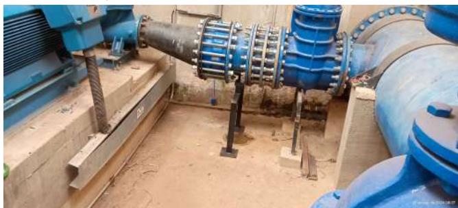
Foto 18 - Ao fundo, boia (sensor) para ativação da bomba de drenagem do fundo do poço seco.
