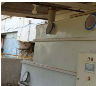
Foto 42 - Sistema de limpeza e exaustão do cloro gás em casos de vazamentos.
