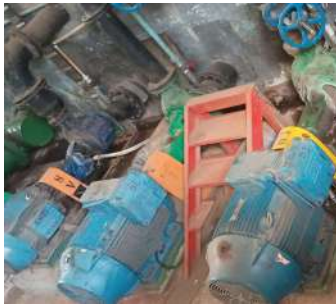
Foto 5 - Vista geral dos conjuntos motobomba da parte interna da EEAT.
