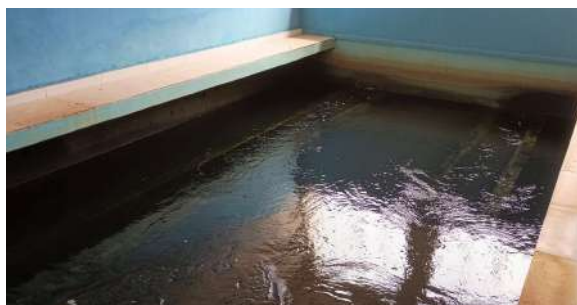
Foto 33 - Filtros do módulo I (ETA I).
