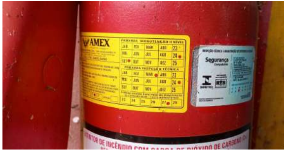
Foto 1 - Validade dos extintores de incêndio expiradas.
