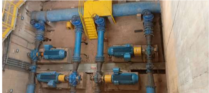
Foto 13 - Vista geral do poço seco de abrigo dos conjuntos motobomba.
