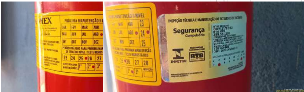
Foto 3 - Extintor de incêndio com prazo vencido.
