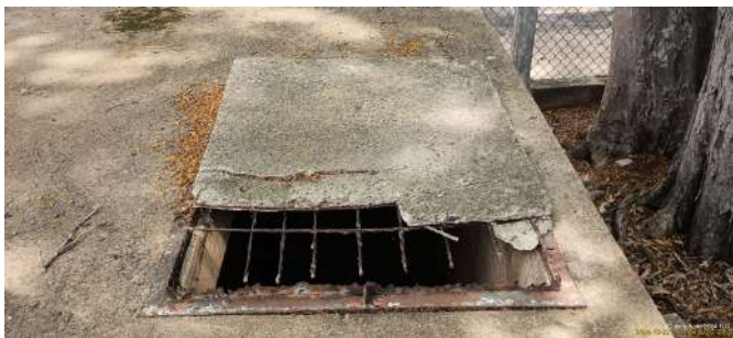
Foto 3 - Tampa de concreto quebrada.
