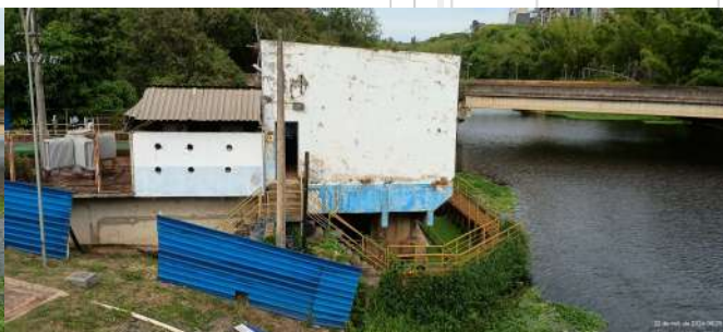
Foto 2 - Captação superficial 2 (antiga) do Rio Piracicaba.
