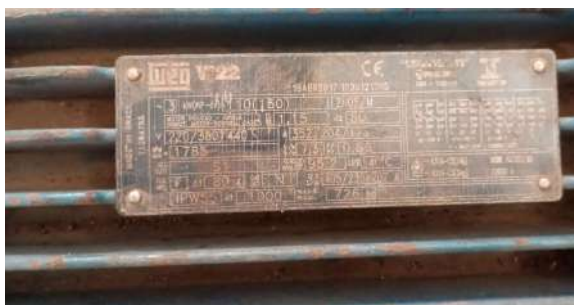
Foto 12 - Placa de especificações técnicas do motor de um dos conjuntos motobomba que recalcam para o CR São Luiz.
