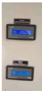
Foto 46 - Painel de acompanhamento de vazões na ETA.
