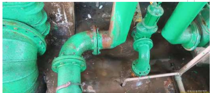
Foto 4 - Vazamento embaixo do filtro da ETA 1.
