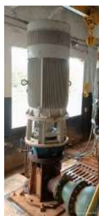
Foto 7 - Segundo conjunto motobomba.
