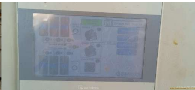
Foto 43 - Sistema de limpeza e exaustão do cloro gás em casos de vazamentos.
