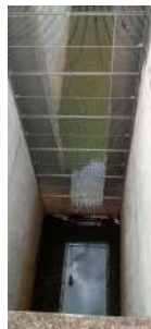
Foto 6 - Vista de um dos 4 poços de entrada de água bruta e gradeamento grosseiro da captação superficial.
