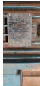
Foto 5 - Placa de especificações técnicas do motor de um dos conjuntos motobomba que recalcam para o São Vito.
