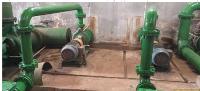
Foto 4 - Conjuntos motobomba que recalcam para o CR São Vito.
