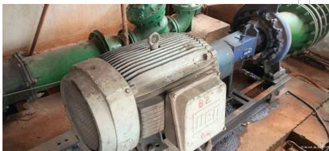
Foto 4 - Um dos conjuntos motobomba em operação.
