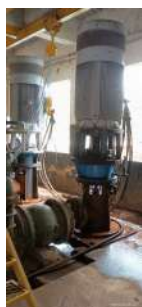
Foto 10 - Terceiro conjunto motobomba.
