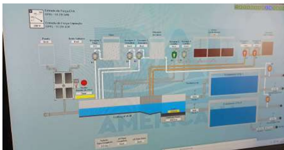
Foto 1 - Sistema de telemetria das vazões da ETA e dos reservatórios.
