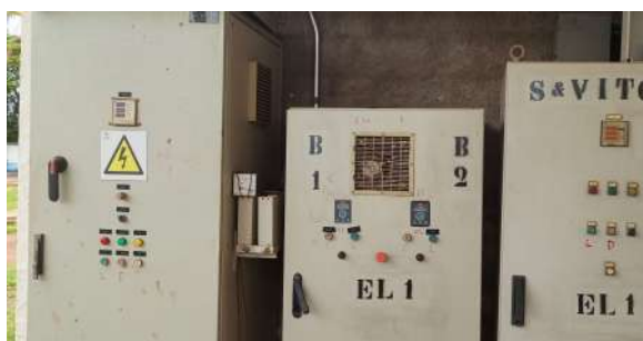
Foto 3 - Painéis elétricos e de comando da EEAT.
