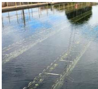
Foto 19 - Decantadores do módulo II (ETA II).
