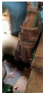
Foto 2 - Detalhe do vazamento no registro.
