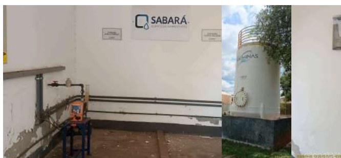
Foto 5 - bombas dosadoras de clorito de sódio e ácido clorídrico.
