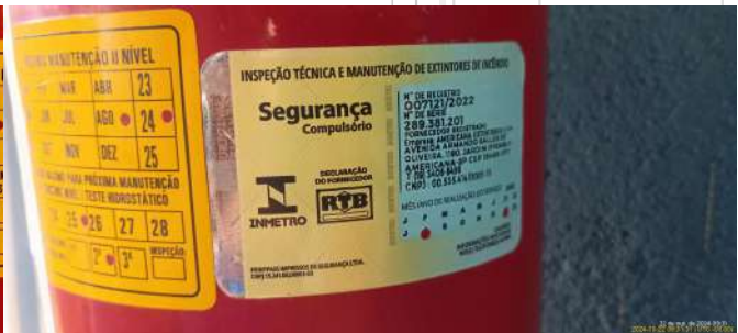
Foto 4 - Extintor de incêndio com prazo vencido.
