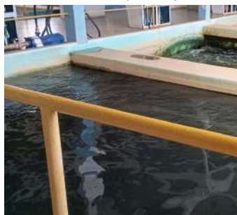
Foto 21 - Filtros do módulo II (ETA II).
