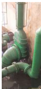
Foto 5 - Vazamento em tubulação embaixo do filtro da ETA 1
