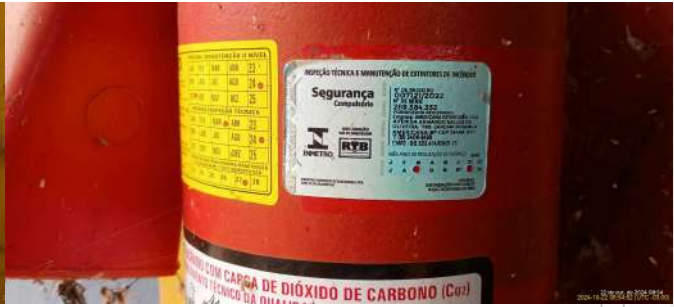
Foto 2 - Validade dos extintores de incêndio expiradas.
