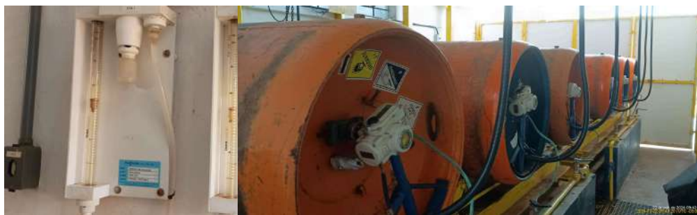
Foto 38 - Dosagem de cloro gás.
