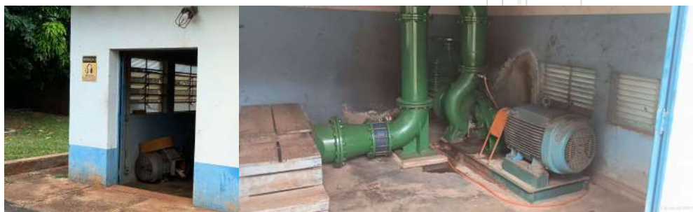
Foto 1 - Casa de bomba do booster.
