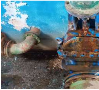
Foto 7 - Vazamento em registro de tubulação abaixo dos filtros da ETA 1.
