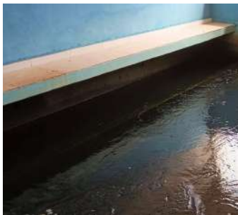
Foto 33 - Filtros do módulo I (ETA I).
