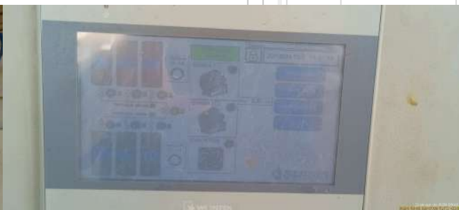
Foto 43 - Sistema de limpeza e exaustão do cloro
