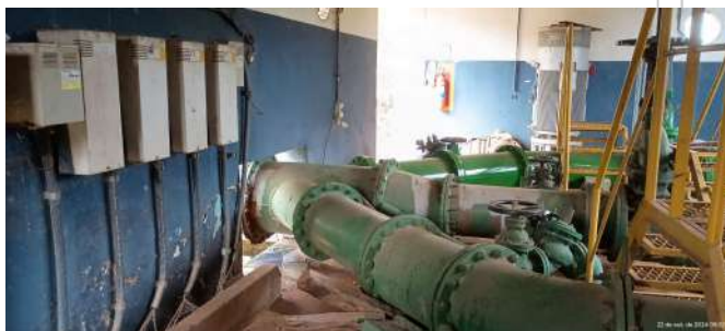
Foto 11 - Barrilete de recalque.
