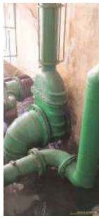
Foto 5 - Vazamento em tubulação embaixo do filtro da ETA 1
