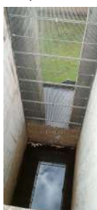
Foto 7 - Vista de um dos 4 poços de entrada de água bruta e gradeamento grosseiro da captação superficial.
