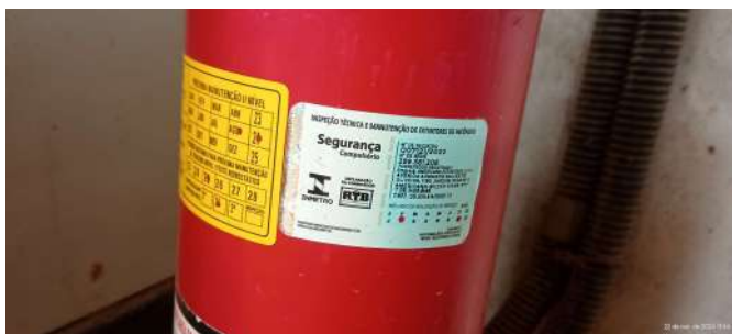
Foto 1 - Prazo para manutenção do extintor vencido.
