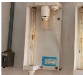
Foto 38 - Dosagem de cloro gás.
