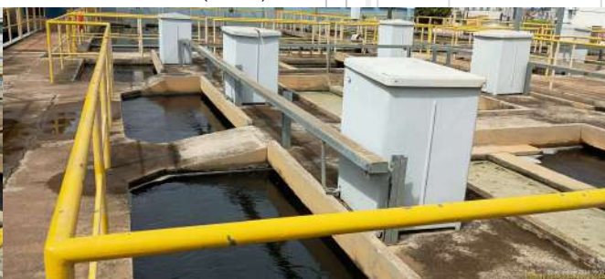
Foto 26 - Floculadores do módulo I (ETA I).
