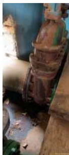
Foto 2 - Detalhe do vazamento no registro.
