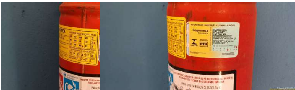
Foto 5 - Extintor de incêndio com prazo vencido. Foto 6 - Extintor de incêndio com prazo vencido.
