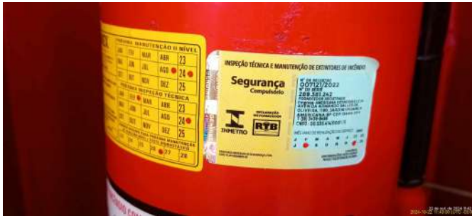
Foto 1 - Validade do extintor expirada.
