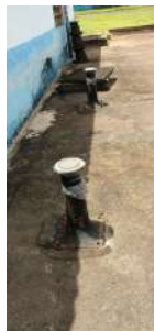
Foto 1 - Tubos de ventilação do reservatório.
