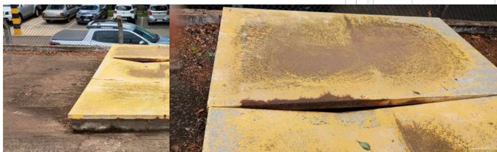
Foto 1 - Tampa metálica retorcida.
