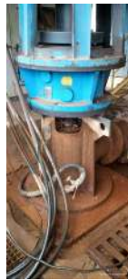
Foto 1 - Vazamento excessivo da água de lubrificação de gaxeta no conjunto motobomba 3.
