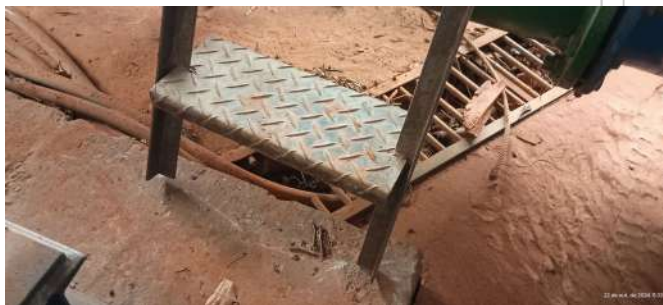
Foto 2 - Detalhe dos pés da escada e seu desnivelamento em relação ao piso.
