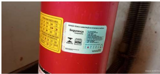
Foto 1 - Prazo para manutenção do extintor vencido.
