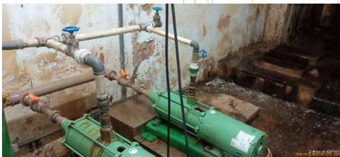
Foto 2 - Vazamento nas bombas de retro lavagem da ETA 2
