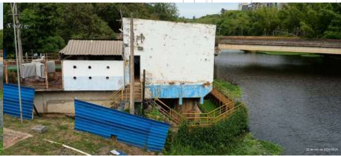
Foto 2 - Captação superficial 2 (antiga) do Rio Piracicaba.
