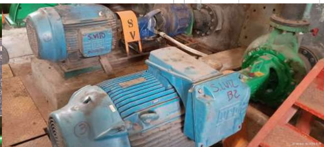
Foto 10 - Conjuntos motobomba do CR São Vito (ao fundo) e B2 do CR São Luiz.
