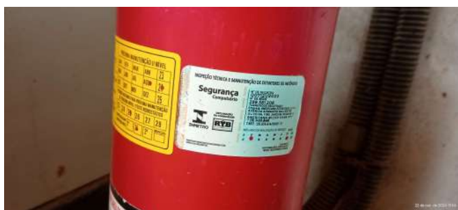
Foto 1 - Prazo para manutenção do extintor vencido.
