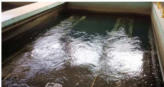
Foto 31 - Filtros do módulo I (ETA I).
