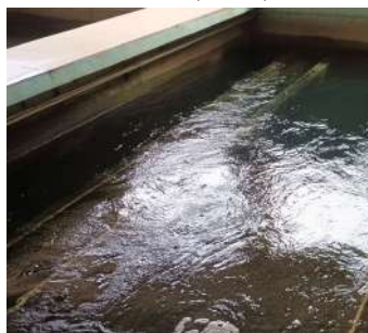
Foto 31 - Filtros do módulo I (ETA I).
