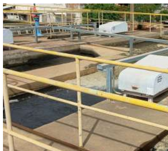
Foto 13 - Floculadores do módulo II (ETA II).
