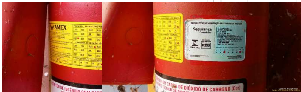
Foto 1 - Validade dos extintores de incêndio expiradas.
