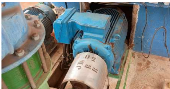
Foto 18 - Um dos conjuntos motobomba que recalcam para o CR Jd. Brasil.
