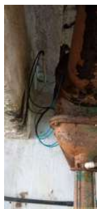
Foto 3 - Vazamento embaixo do filtro da ETA 1.
