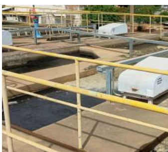
Foto 13 - Floculadores do módulo II (ETA II).
