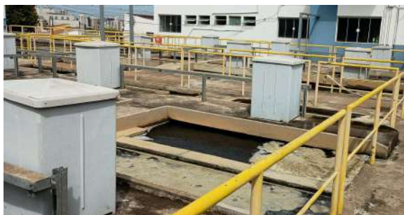
Foto 25 - Flocculadores do módulo I (ETA I).
