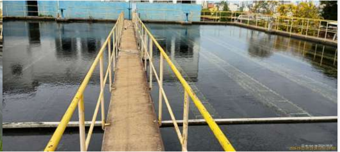
Foto 16 - Decantadores do módulo II (ETA II).
