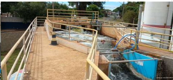
Foto 2 - Chegada de água bruta e aplicação de produtos químicos no início do processo.
