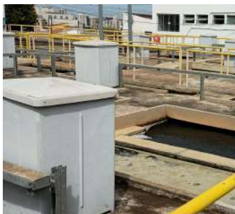
Foto 25 - Floculadores do módulo I (ETA I).
