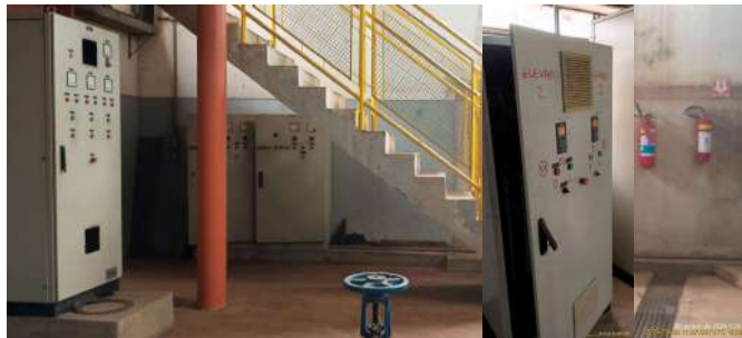
Foto 8 - Escada de acesso ao piso da EEAT 2, painel elétrico e de comando e extintores da EEAT.
