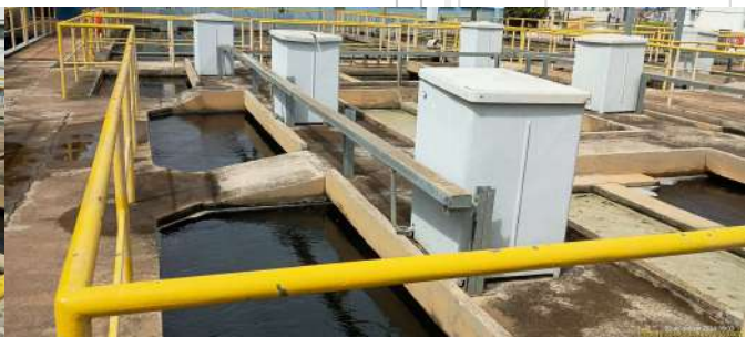
Foto 26 - Floculadores do módulo I (ETA I).
