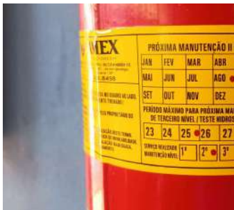
Foto 3 - Extintor de incêndio com prazo vencido.
