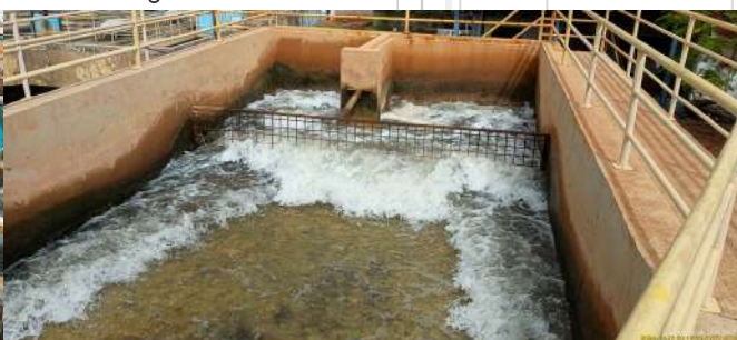
Foto 8 - Divisão da vazão para direcionamento aos módulos I e II.
