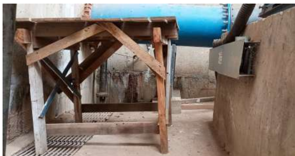
Foto 5 - Pontos de infiltração na parede e próximo ao piso do poço seco.
