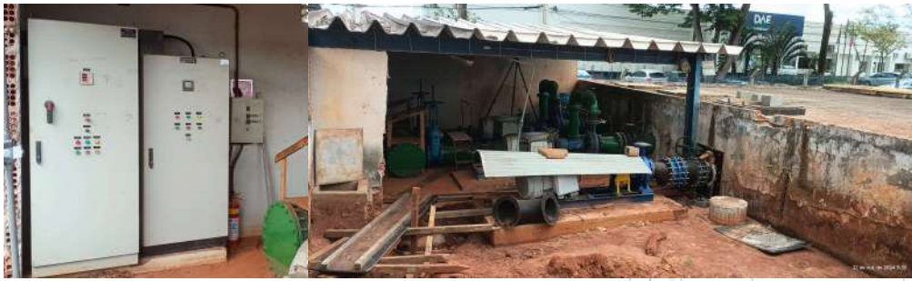
Foto 5 - Painéis elétricos e de comando da EEAT.
