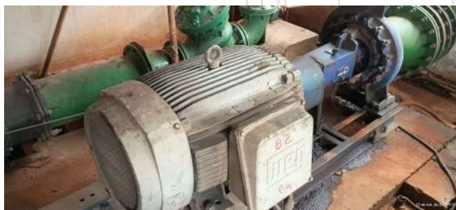
Foto 4 - Um dos conjuntos motobomba em operação.
