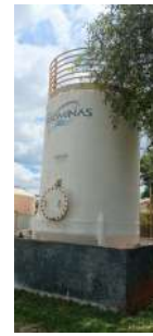
Foto 6 - Ausência de identificação do do tanque de hidróxido de cálcio.
