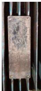
Foto 3 - Placa de especificações técnicas do motor de um dos conjuntos motobomba que recalcam para o CR Jd. Alvorada.
