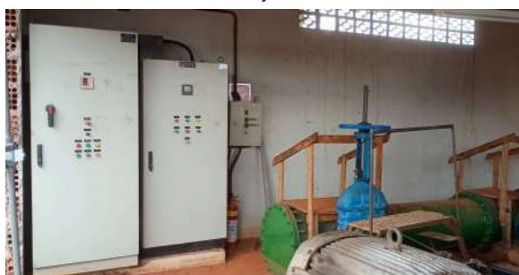
Foto 5 - Painéis elétricos e de comando da EEAT.
