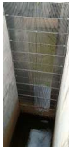
Foto 5 - Vista de um dos 4 poços de entrada de água bruta e gradeamento grosseiro da captação superficial.
