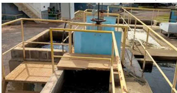
Foto 11 - Chegada da água bruta no módulo II.
