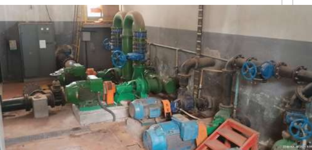
Foto 4 - Vista geral dos conjuntos motobomba da parte interna da EEAT.
