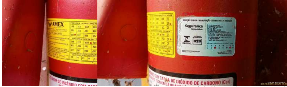
Foto 1 - Validade dos extintores de incêndio expiradas.
