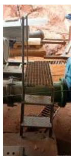
Foto 1 - Escada utilizada para acesso entre as tubulações.
