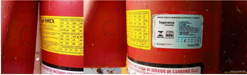
Foto 1 - Validade dos extintores de incêndio expiradas.
