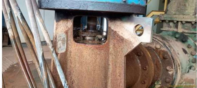
Foto 2 - Vazamento excessivo da água de lubrificação de gaxeta no conjunto motobomba 3.
