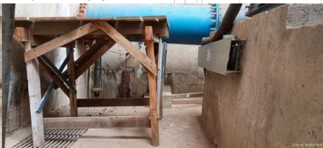
Foto 5 - Pontos de infiltração na parede e próximo ao piso do poço seco.
