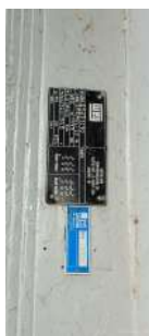
Foto 8 - Placa de especificações técnicas do motor de um dos conjuntos motobomba.
