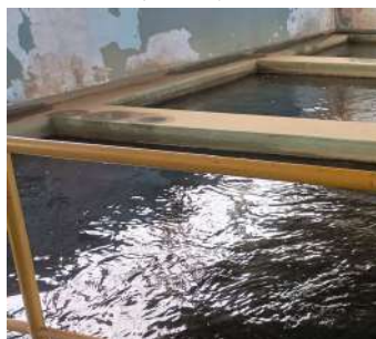
Foto 23 - Filtros do módulo II (ETA II).
