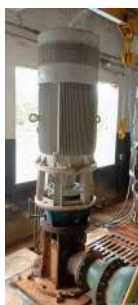
Foto 7 - Segundo conjunto motobomba.
