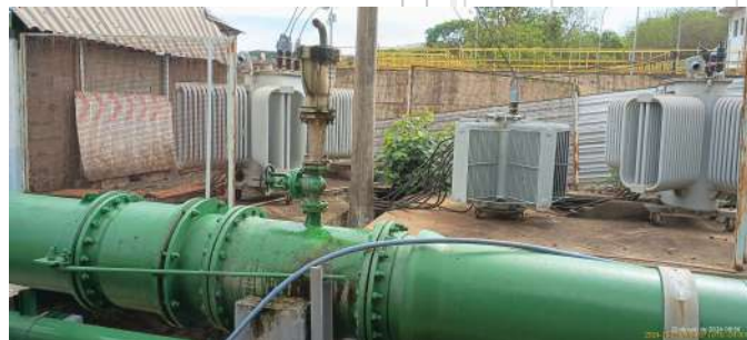
Foto 4 - Vazamento na ventosa da adutora de recalque.
