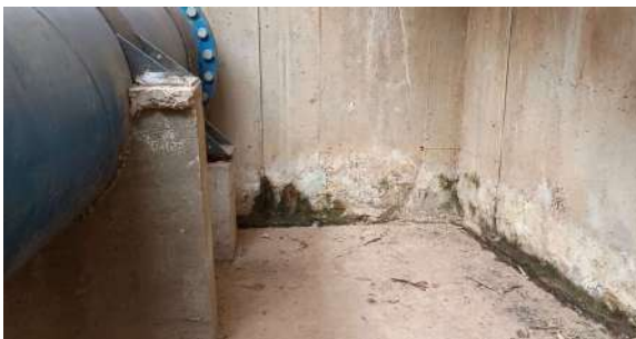
Foto 1 - Pontos de infiltração próximo ao piso do poço seco.
