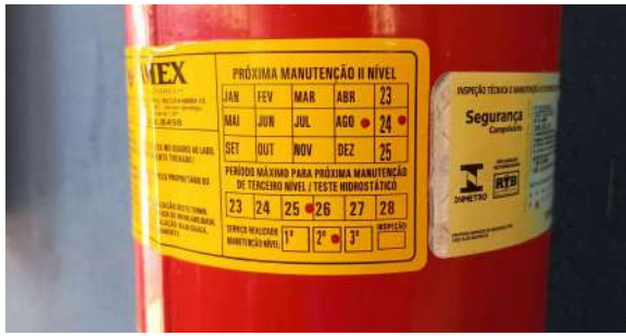
Foto 3 - Extintor de incêndio com prazo vencido.
