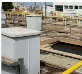
Foto 25 - Floculadores do módulo I (ETA I).
