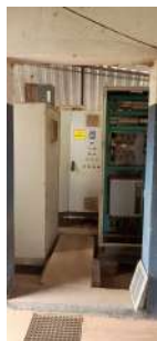
Foto 12 - Painéis elétricos e de comando dos conjuntos motobomba.
