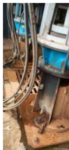
Foto 1 - Drenagem inadequada da água de lubrificação de gaxetas do conjunto motobomba 3.
