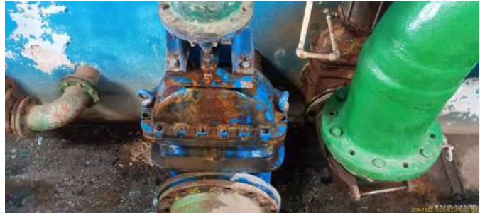
Foto 7 - Vazamento em registro de tubulação abaixo dos filtros da ETA 1.
