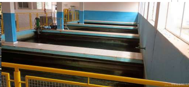
Foto 30 - Filtros do módulo I (ETA I).
