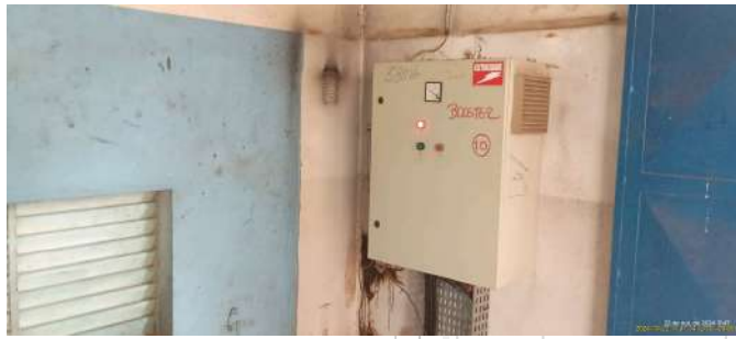
Foto 4 - Painel elétrico do booster.
