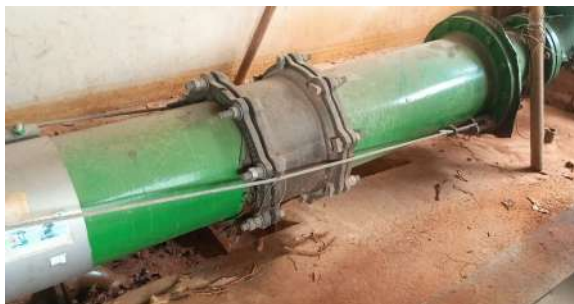
Foto 1 - Trecho da adutora com vazamento.
