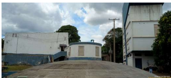
Foto 1 - Tubulação de ventilação com tela.
