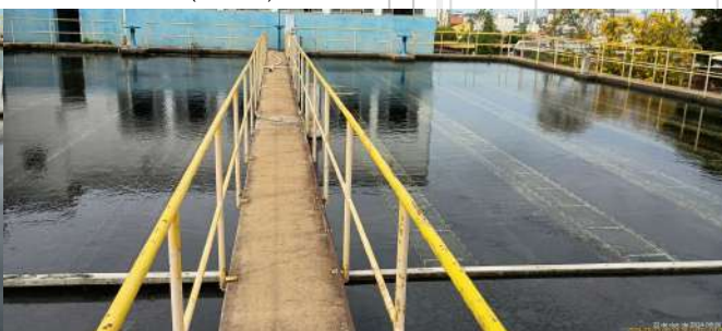
Foto 16 - Decantadores do módulo II (ETA II).
