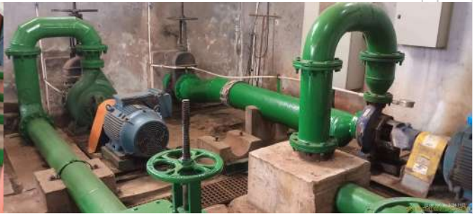
Foto 2 - Conjuntos motobomba que recalcam para CR Jardim Alvorada.
