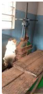
Foto 1 - Vazamento no registro da tubulação de adução.
