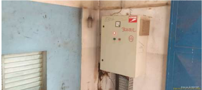
Foto 4 - Painelelétrico do booster.
