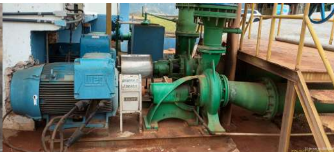
Foto 16 - Vista do conjuntos motobomba situados do lado externo, que recalcam para o CR Jd. Brasil
