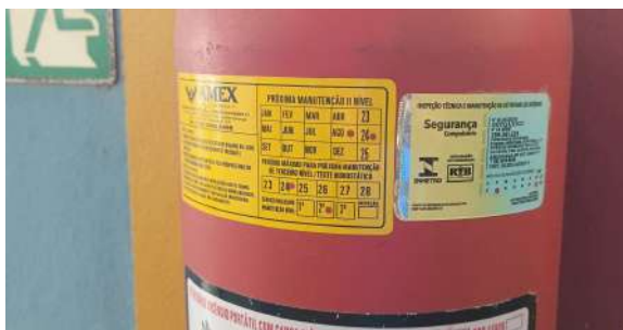
Foto 1 - Extintor de incêndio com prazo vencido.
