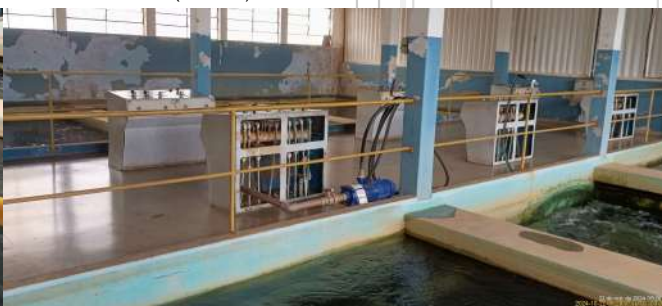
Foto 22 - Filtros do módulo II (ETA II).
