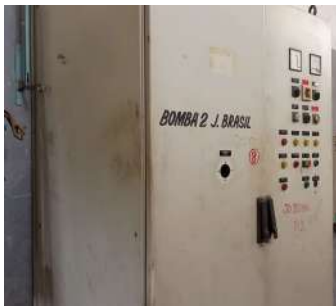
Foto 7 - Painéis elétricos e de comando situados na parte interna da EEAT.
