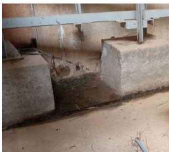
Foto 4 - Pontos de infiltração próximo ao piso do poço seco.
