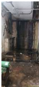
Foto 1 - Vazamentos na alvenaria da transição entre decantador e filtro da ETA 2
