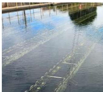
Foto 19 - Decantadores do módulo II (ETA II).
