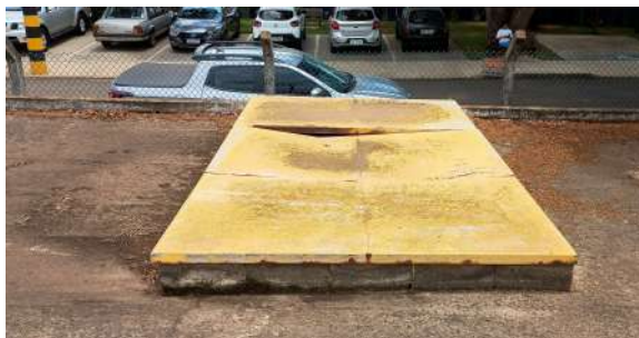
Foto 1 - Tampa metálica retorcida.
