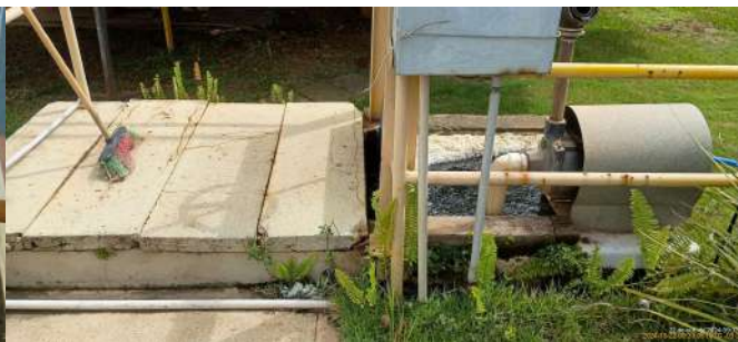
Foto 24 - Chegada da água bruta no módulo I (ETA I).
