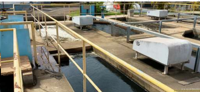
Foto 12 - Floculadores do módulo II (ETA II).
