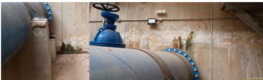
Foto 1 - Pontos de infiltração próximo ao piso do poço seco.
