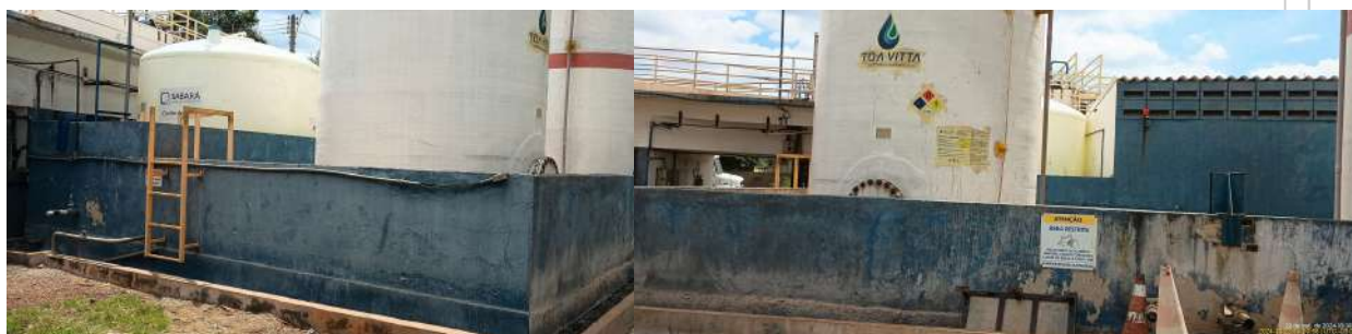
Foto 1 - Bacia de contenção e identificação do tanque de clorito de sódio.
