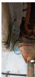
Foto 3 - Vazamento embaixo do filtro da ETA 1.
