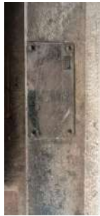
Foto 3 - Placa de especificações técnicas do motor de um dos conjuntos motobomba.
