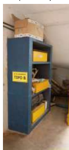
Foto 35 - Equipamentos de emergência do sistema de cloro gás.
