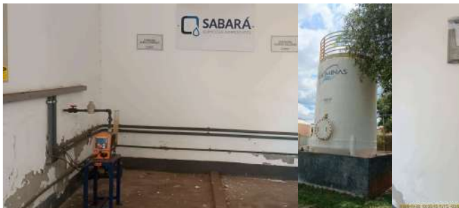
Foto 5 - bombas dosadoras de clorito de sódio e ácido clorídrico.
