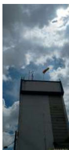
Foto 1 - Para-raio do reservatório.
