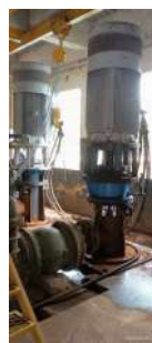
Foto 10 - Terceiro conjunto motobomba.
