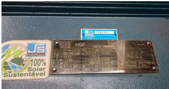
Foto 16 - Placa de especificações técnicas de um dos conjuntos motobomba de recalque.
