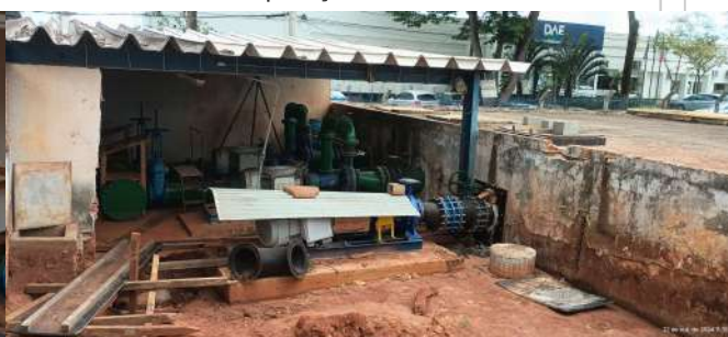
Foto 6 - Vista geral da área e do terceiro conjunto motobomba da EEAT (à frente e em processo de instalação).
