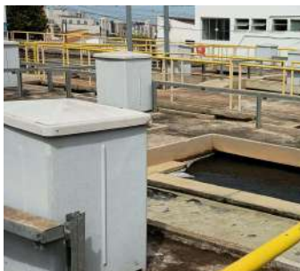
Foto 25 - Floculadores do módulo I (ETA I).
