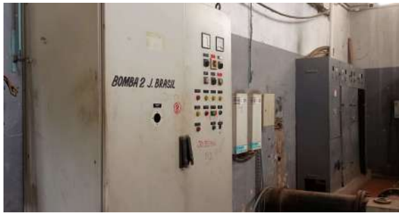
Foto 7 - Painéis elétricos e de comando situados na parte interna da EEAT.
