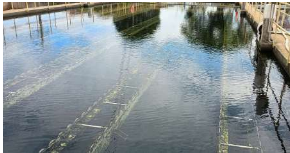
Foto 19 - Decantadores do módulo II (ETA II).
