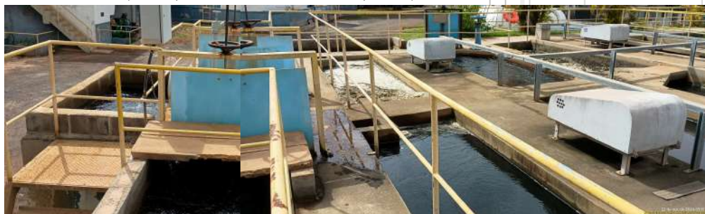
Foto 11 - Chegada da água bruta no módulo II.
