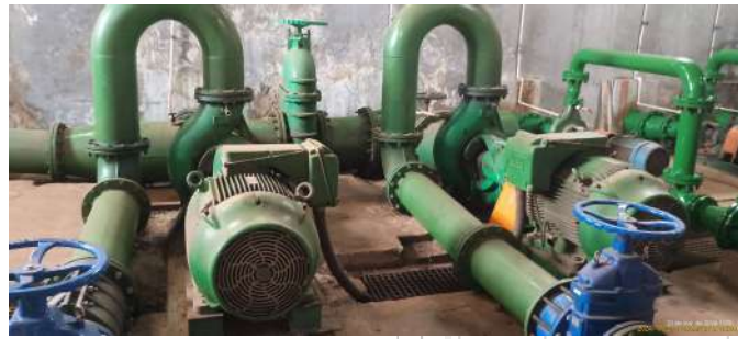
Foto 6 - Conjuntos motobomba que recalcam para o reservatório elevado ETA 2.
