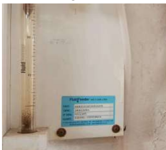
Foto 40 - Dosagem de cloro gás.
