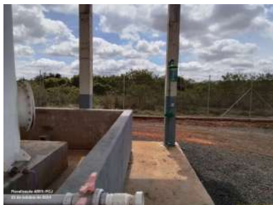
Foto 1 - Chuveiro de emergência junto aos tanques de hipoclorito.
