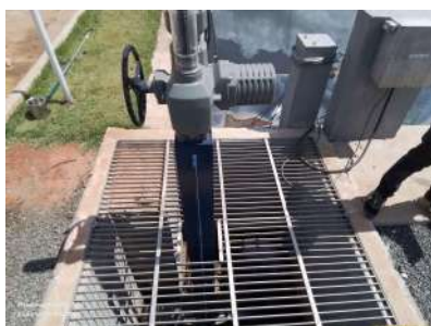
Foto 26 - Primeira válvula automática de saída do tanque 3A.
