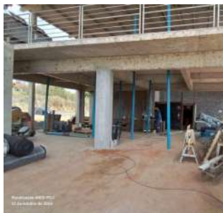
Foto 71 - Vista do piso inferior do sistema de tratamento de lodo.
