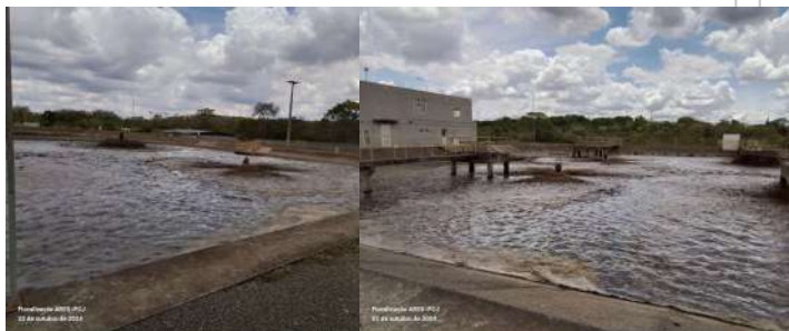
Foto 3 - Vista do aerador operando no tanque 2.
