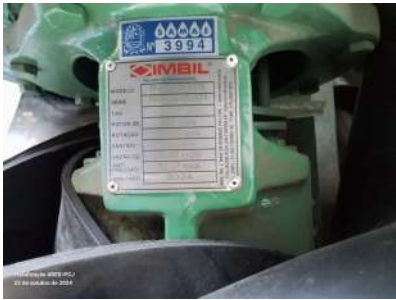
Foto 1 - Descrição da bomba.
