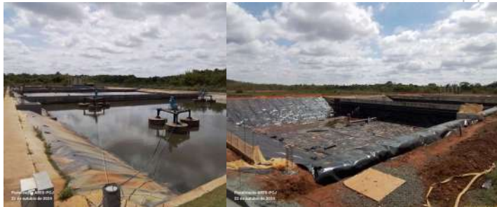
Foto 22 - Vista da unidade de tratamento A (etapa 1).
