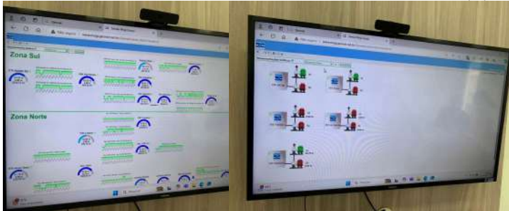
Foto 10 - Aba: Bombeamento. Foto 11 - Aba: Elevatórias de esgoto.
