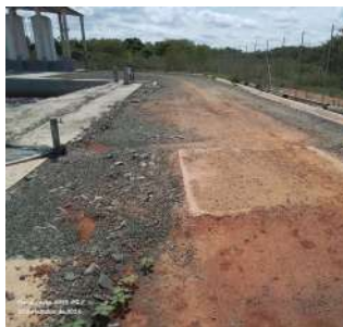
Foto 34 - EEE subterrânea de descarte de lodo do tanque 1A.
