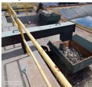
Foto 14 - Caçamba para material retido nas grades.
