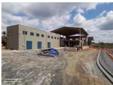
Foto 24 - Vista da casa de força e painéis elétricos de operação e galpão de tratamento de lodo ao fundo.
