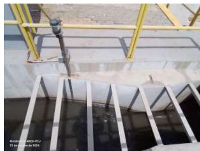
Foto 17 - Calha Parshall de entrada com medidor não operante.
