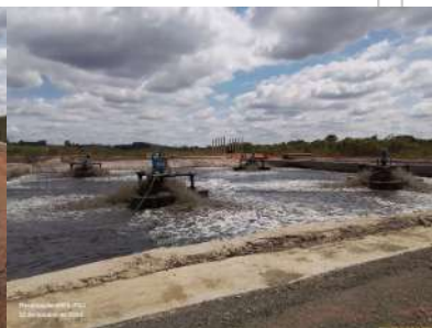
Foto 31 - Vista do tanque de aeração 1A com 4 aeradores. Funciona 3 horas como aeração e 3 horas como decantador.
