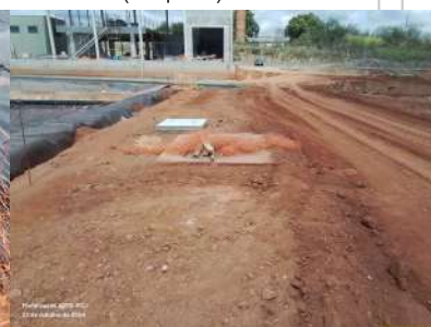
Foto 54 - EEE subterrânea de descarte de lodo do tanque 3B (etapa 2).
