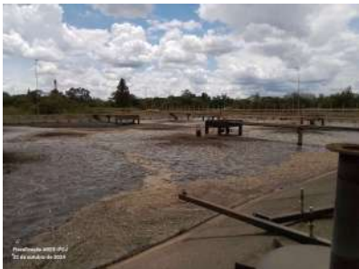
Foto 5 - Vista de um aerador no tanque 1.
