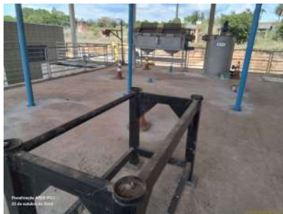
Foto 62 - Suporte de espera para a centrífuga 1.
