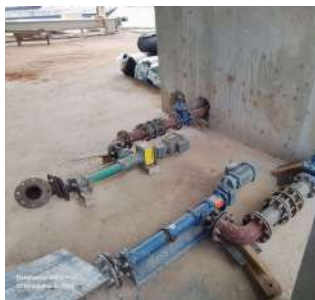
Foto 61 - Futuro sistema de recalque lodo do tanque de chegada para centrífuga.
