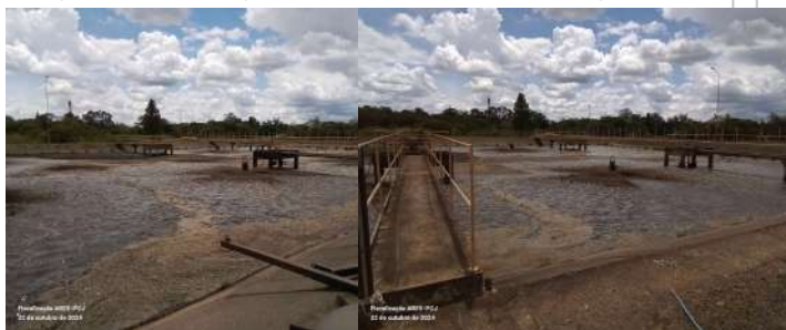
Foto 5 - Vista de um aerador no tanque 1.
