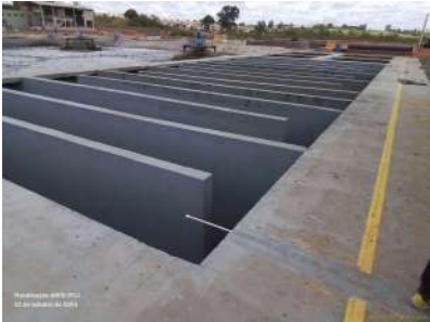
Foto 1 - Tanque de contato sem guarda-corpo.
