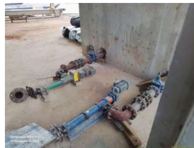
Foto 61 - Futuro sistema de recalque lodo do tanque de chegada para centrífuga.
