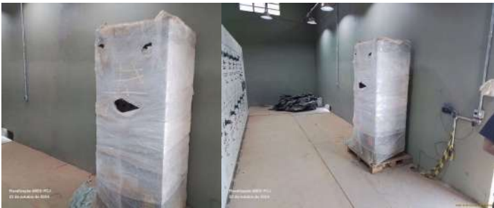
Foto 74 - Pannel de controle polímero (etapa 2).
