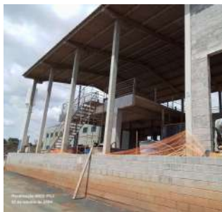
Foto 57 - Vista do sistema de tratamento de lodo (etapa 2).
