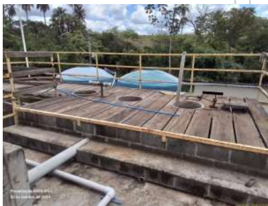
Foto 10 - Sequência de 3 tanques anaeróbios (conjunto 1).
