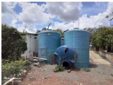
Foto 1 - Vista dos tanques complementares instalados.
