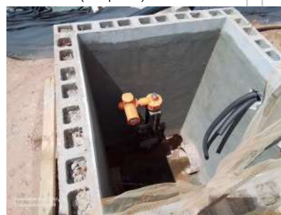
Foto 48 - Primeira válvula automática de saída do tanque 1B (etapa 2).
