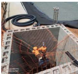
Foto 49 - Segunda válvula automática de saída do tanque 1B (etapa 2).
