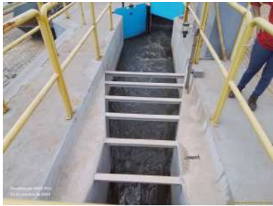
Foto 5 - Calha Parshall com sensor aguardando calibração.
