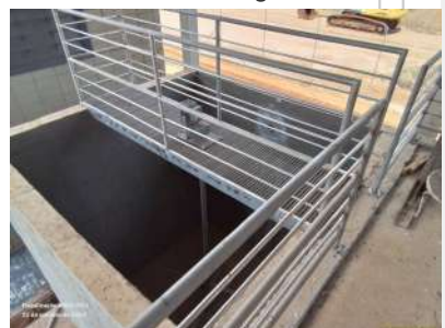
Foto 64 - Tanque de chegada de lodo da unidade A.
