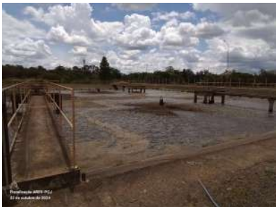
Foto 6 - Vista de dois aeradores no tanque 1.
