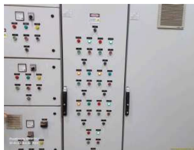
Foto 73 - Controle das válvulas da unidade A (1 etapa).
