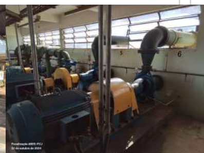
Foto 9 - EEA Zaniboni com capacidade atual de 500 m³/h. Com a nova bomba
