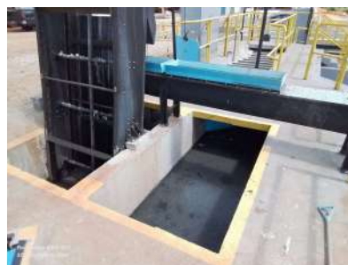
Foto 15 - Local de instalação de segunda grade fina mecanizada em paralelo (etapa 2).
