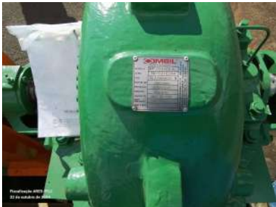
Foto 3 - Descrição da bomba 1.
