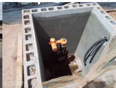
Foto 48 - Primeira válvula automática de saída do tanque 1B (etapa 2).
