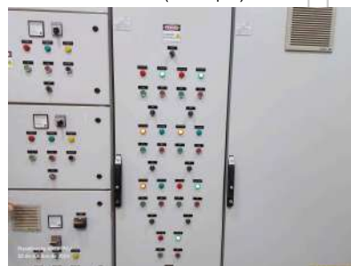
Foto 73 - Controle das válvulas da unidade A (1 etapa).
