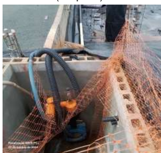
Foto 53 - Primeira válvula automática de saída do tanque 3B (etapa 2).
