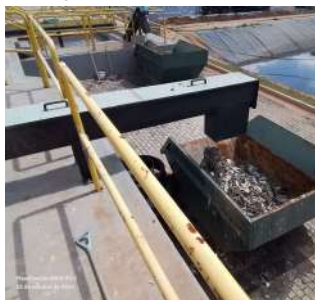
Foto 14 - Caçamba para material retido nas grades.
