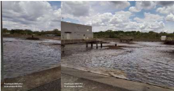
Foto 3 - Vista do aerador operando no tanque 2. Foto 4 - Vista de dois aeradores no tanque 1.
