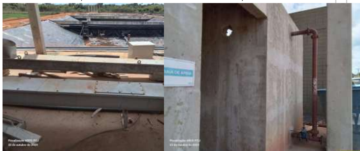
Foto 59 - Maquinário do sistema de tratamento de lodo (etapa 2).
