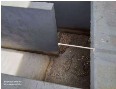
Foto 38 - Material flutuante acumulado no tanque de contato A.
