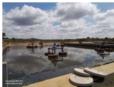
Foto 25 - Vista do tanque de aeração 3A com 4 aeradores. Funciona 3 horas como aeração e 3 horas como decantador.
