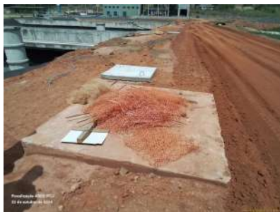
Foto 50 - EEE subterrânea de descarte de lodo do tanque 1B (etapa 2).
