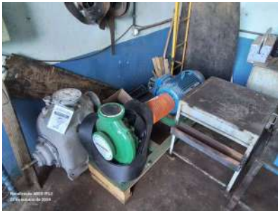
Foto 3 - Vista da bomba no estoque do almoxarifado do SAMAE na Av. Paulista, 387.
