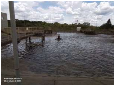
Foto 2 - Vista de dois aeradores no tanque 1.
