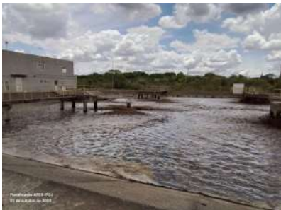
Foto 4 - Vista de dois aeradores no tanque 1.
