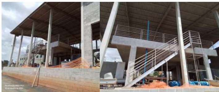
Foto 57 - Vista do sistema de tratamento de lodo (etapa 2).
