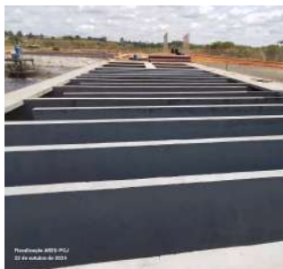
Foto 36 - Vista do tanque de contato da unidade A (etapa 1).
