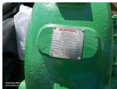
Foto 5 - Descrição da bomba 3.
