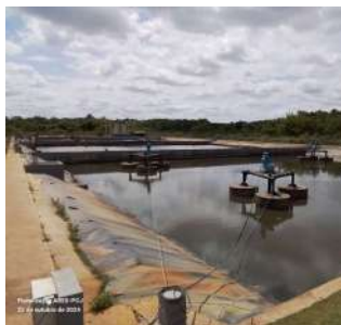
Foto 22 - Vista da unidade de tratamento A (etapa 1).
