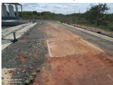
Foto 34 - EEE subterrânea de descarte de lodo do tanque 1A.
