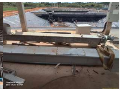
Foto 59 - Maquinário do sistema de tratamento de lodo (etapa 2).
