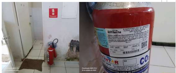
Foto 1 - Extintor no setor administrativo.
