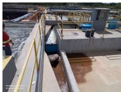
Foto 21 - Vista da calha de saída do tratamento preliminar.
