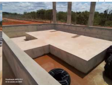
Foto 46 - Baía de contenção dos tanques de hipoclorito unidade B (etapa 2).
