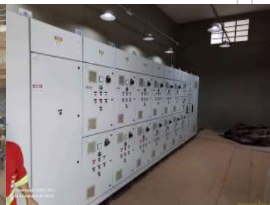
Foto 72 - Painéis elétricos da unidade A (1 etapa).
