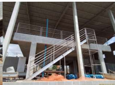
Foto 58 - Vista do sistema de tratamento de lodo (etapa 2).
