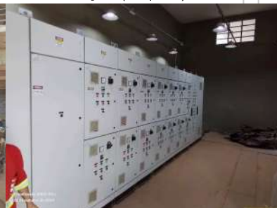
Foto 72 - Painéis elétricos da unidade A (1 etapa).
