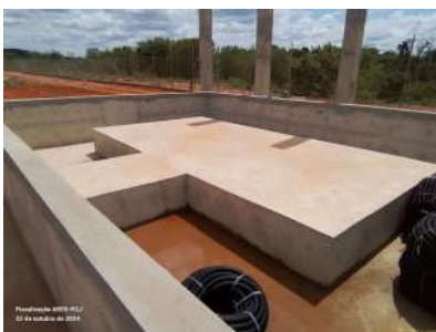
Foto 46 - Baía de contenção dos tanques de hipoclorito unidade B (etapa 2).
