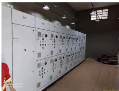
Foto 72 - Painéis elétricos da unidade A (1 etapa).
