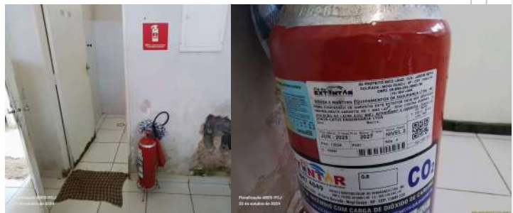
Foto 1 - Extintor no setor administrativo.
