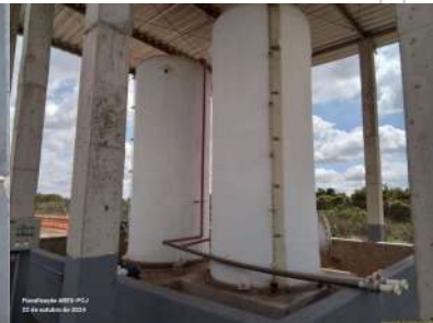
Foto 39 - Tanques de hipoclorito da unidade A (etapa 1).
