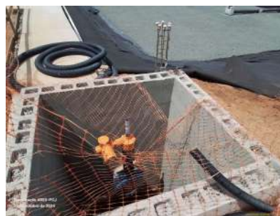
Foto 49 - Segunda válvula automática de saída do tanque 1B (etapa 2).
