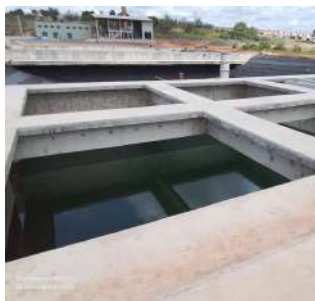
Foto 44 - Tanque de aeração final da unidade B (etapa 2).
