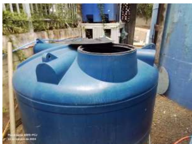
Foto 5 - Tanque de organismos autóctones que consomem o lodo produzido. São aplicados no tanque de mistura.
