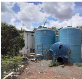
Foto 1 - Vista dos tanques complementares instalados.
