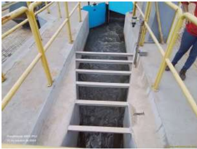
Foto 5 - Calha Parshall com sensor aguardando calibração.
