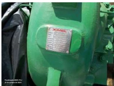
Foto 4 - Descrição da bomba 2.
