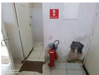
Foto 1 - Extintor no setor administrativo.
