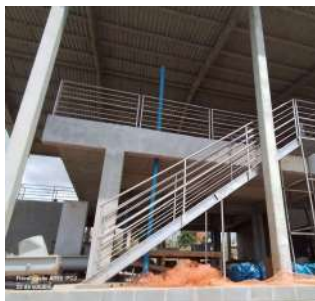
Foto 58 - Vista do sistema de tratamento de lodo (etapa 2).
