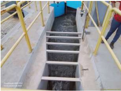
Foto 5 - Calha Parshall com sensor aguardando calibração.
