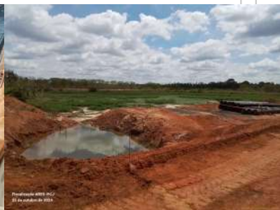
Foto 56 - Remanescente da lagoa anaeróbia antiga.
