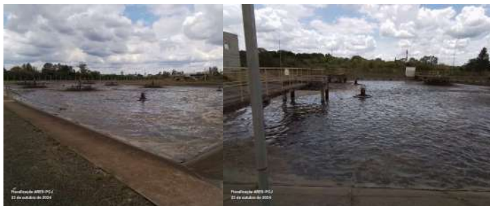
Foto 1 - Vista do aerador parado no tanque 2.
