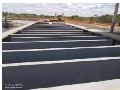
Foto 36 - Vista do tanque de contato da unidade A (etapa 1).
