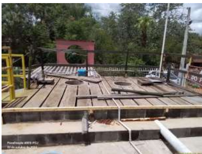
Foto 15 - Sequência de 3 tanques anaeróbios (conjunto 2).
