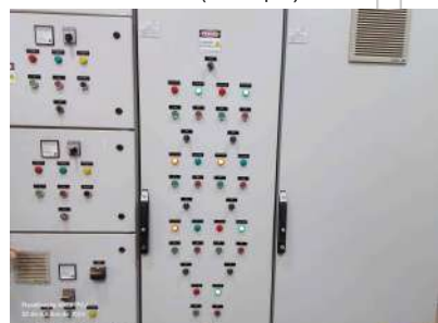
Foto 73 - Controle das válvulas da unidade A (1 etapa).
