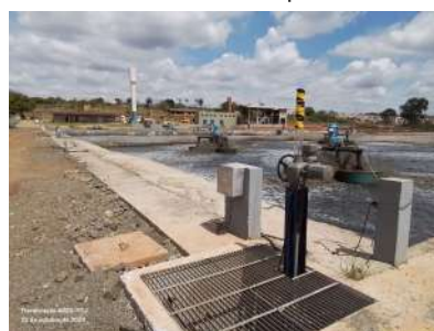
Foto 35 - Segunda válvula automática de saída do tanque 1A.
