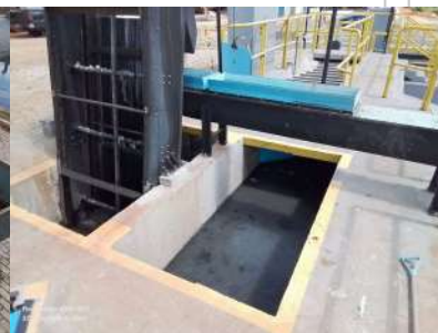
Foto 15 - Local de instalação de segunda grade fina mecanizada em paralelo (etapa 2).
