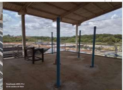
Foto 66 - Piso das centrífugas com tratamento
