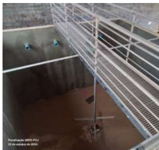
Foto 65 - Tanque de chegada de lodo da unidade
