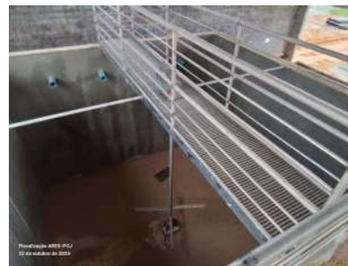
Foto 65 - Tanque de chegada de lodo da unidade B.
