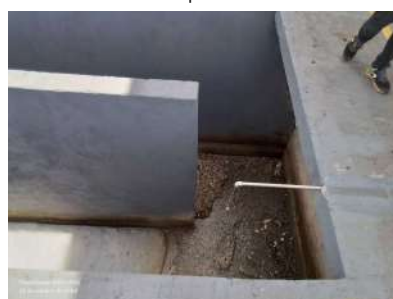
Foto 37 - Aplicação de hipoclorito de sódio no início do tanque de contato.
