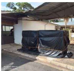
Foto 8 - Painéis de operação esticados na ETA.
