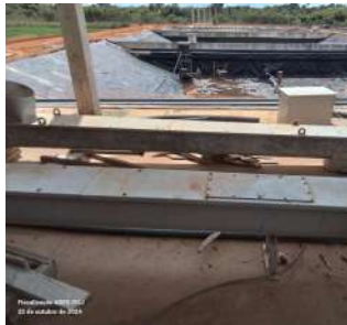
Foto 59 - Maquinário do sistema de tratamento de lodo (etapa 2).
