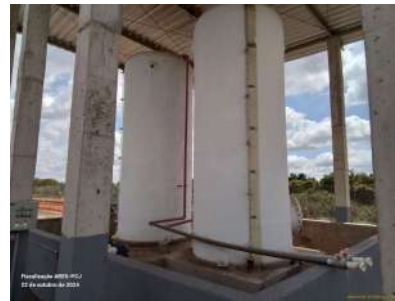
Foto 39 - Tanques de hipoclorito da unidade A (etapa 1).
