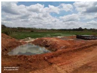
Foto 56 - Remanescente da lagoa anaeróbia antiga.
