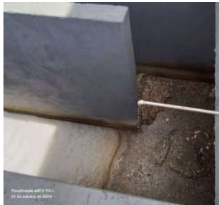
Foto 38 - Material flutuante acumulado no tanque de contato A.
