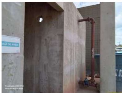
Foto 60 - Tubulação e tanque de chegada do lodo da unidade A.
