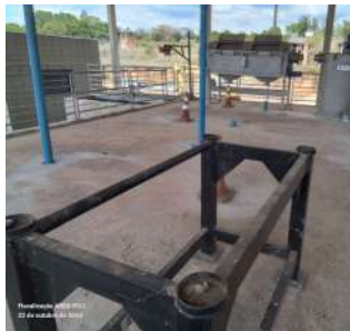
Foto 62 - Suporte de espera para a centrífuga 1.
