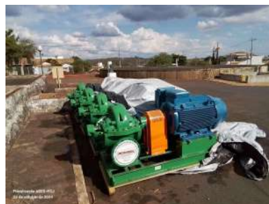
Foto 7 - Bombas estocadas na ETA.
