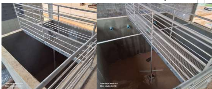
Foto 64 - Tanque de chegada de lodo da unidade A.
