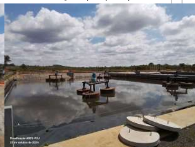
Foto 25 - Vista do tanque de aeração 3A com 4 aeradores. Funciona 3 horas como aeração e 3 horas como decantador.
