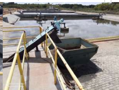
Foto 19 - Caçamba para remoção da areia do desarenador.
