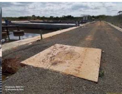
Foto 27 - EEE subterrânea de descarte de lodo do tanque 3A.
