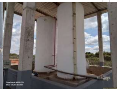
Foto 39 - Tanques de hipoclorito da unidade A (etapa 1).
