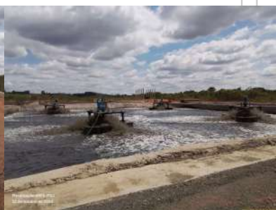
Foto 31 - Vista do tanque de aeração 1A com 4 aeradores. Funciona 3 horas como aeração e 3 horas como decantador.
