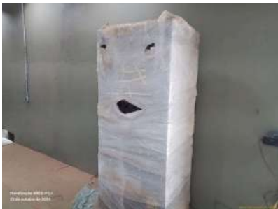
Foto 74 - Painel de controle polímero (etapa 2).
