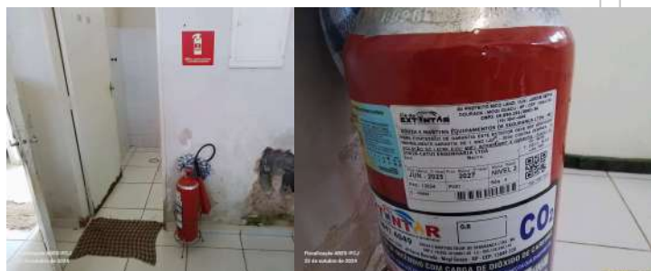
Foto 1 - Extintor no setor administrativo.
