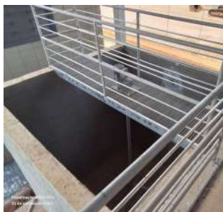
Foto 64 - Tanque de chegada de lodo da unidade A.
