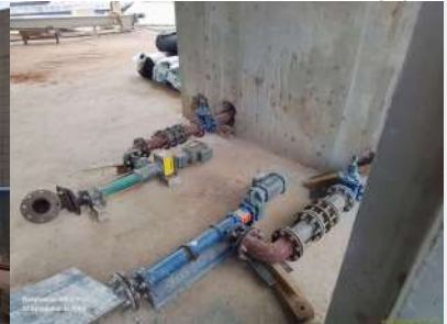
Foto 61 - Futuro sistema de recalque lodo do tanque de chegada para centrífuga.
