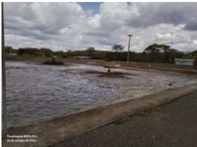
Foto 3 - Vista do aerador operando no tanque 2.
