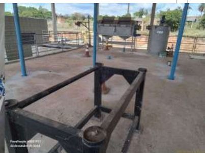
Foto 62 - Suporte de espera para a centrífuga 1.
