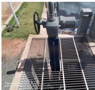
Foto 26 - Primeira válvula automática de saída do tanque 3A.
