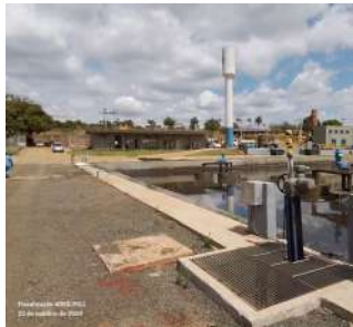
Foto 28 - Segunda válvula automática de saída do tanque 3A.
