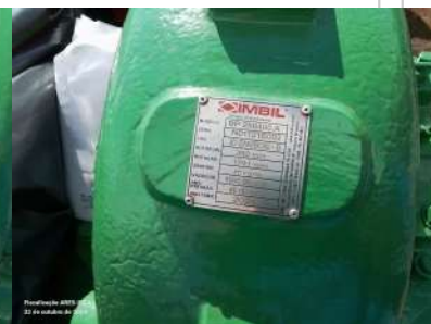
Foto 5 - Descrição da bomba 3.
