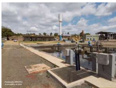
Foto 28 - Segunda válvula automática de saída do tanque 3A.
