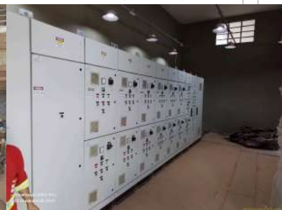
Foto 72 - Painéis elétricos da unidade A (1 etapa).
