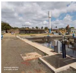
Foto 28 - Segunda válvula automática de saída do tanque 3A.
