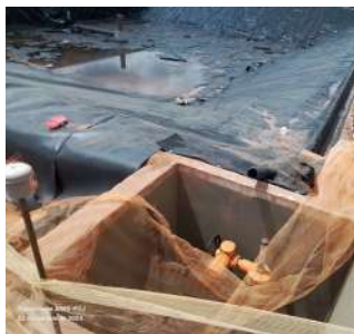
Foto 55 - Segunda válvula automática de saída do tanque 3B (etapa 2).
