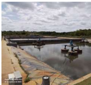
Foto 22 - Vista da unidade de tratamento A (etapa 1).
