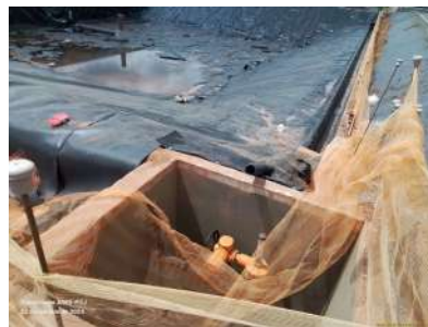
Foto 55 - Segunda válvula automática de saída do tanque 3B (etapa 2).
