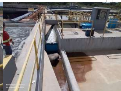
Foto 21 - Vista da calha de saída do tratamento preliminar.
