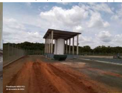
Foto 41 - Vista dos tanques de hipoclorito da unidade A (etapa 1).
