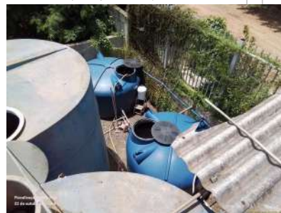
Foto 17 - Vista dos tanques de organismos aplicados no sistema.
