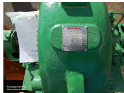
Foto 3 - Descrição da bomba 1.
