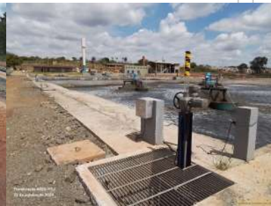
Foto 35 - Segunda válvula automática de saída do tanque 1A.
