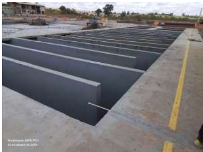
Foto 1 - Tanque de contato sem guarda-corpo.
