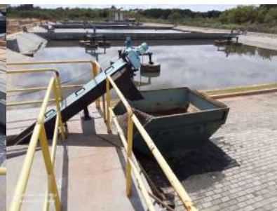
Foto 19 - Caçamba para remoção da areia do desarenador.
