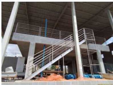
Foto 58 - Vista do sistema de tratamento de lodo (etapa 2).
