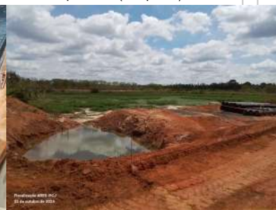
Foto 56 - Remanescente da lagoa anaeróbia antiga.
