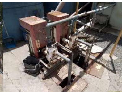
Foto 21 - EEE de entrada.
