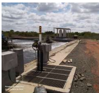
Foto 30 - Primeira válvula automática de saída do tanque 1A.
