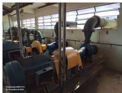
Foto 9 - EEA Zaniboni com capacidade atual de 500 m³/h. Com a nova bomba aumentará para 1000 m³/h. A atual bomba tem muitos reparos.
