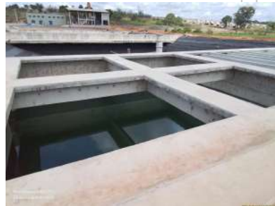
Foto 44 - Tanque de aeração final da unidade B (etapa 2).
