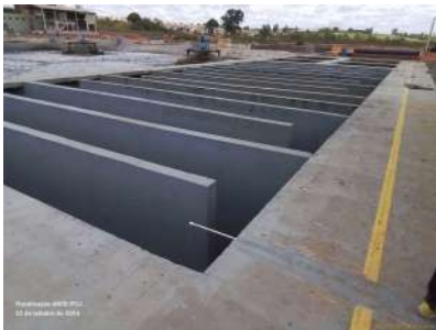
Foto 1 - Tanque de contato sem guarda-corpo.
