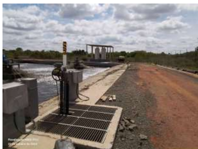
Foto 30 - Primeira válvula automática de saída do tanque 1A.
