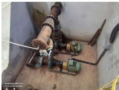
Foto 12 - EEA Vila Paraíso com capacidade atual de 800 m³/h. Com a nova bomba aumentará para 1000 m³/h.
