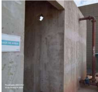
Foto 60 - Tubulação e tanque de chegada do lodo da unidade A.
