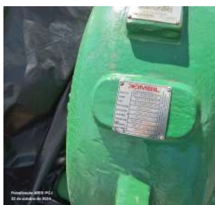
Foto 6 - Descrição da bomba 4.
