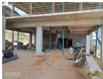
Foto 71 - Vista do piso inferior do sistema de tratamento de lodo.
