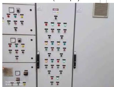
Foto 73 - Controle das válvulas da unidade A (1 etapa).
