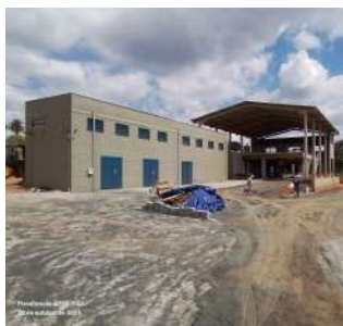
Foto 24 - Vista da casa de força e painéis elétricos de operação e galpão de tratamento de lodo ao fundo.
