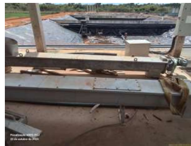
Foto 59 - Maquinário do sistema de tratamento de lodo (etapa 2).
