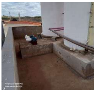
Foto 40 - Baía de contenção dos tanques de hipoclorito (etapa 1).
