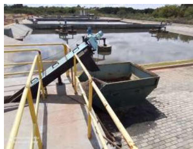
Foto 19 - Caçamba para remoção da areia do desarenador.
