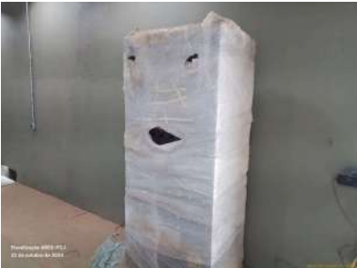
Foto 74 - Painel de controle polímero (etapa 2).
