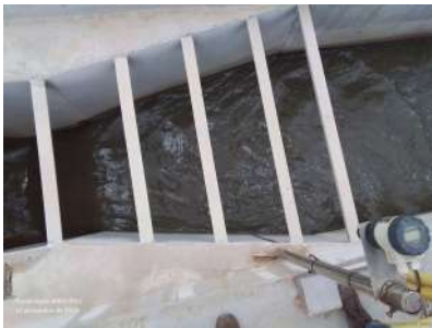
Foto 4 - Calha Parshall com graduação de nível para medição.
