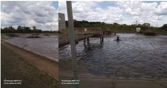
Foto 1 - Vista do aerador parado no tanque 2. Foto 2 - Vista de dois aeradores no tanque 1.
