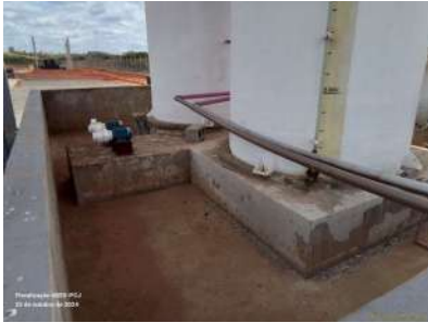
Foto 40 - Baía de contenção dos tanques de hipoclorito (etapa 1).
