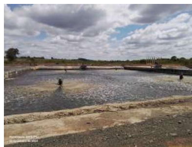
Foto 29 - Vista do tanque de aeração 2A com 4 aeradores. Recebe todo o efluente de entrada e funciona com aeração contínua.
