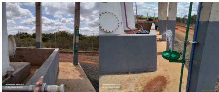
Foto 1 - Chuveiro de emergência junto aos tanques de hipoclorito.
