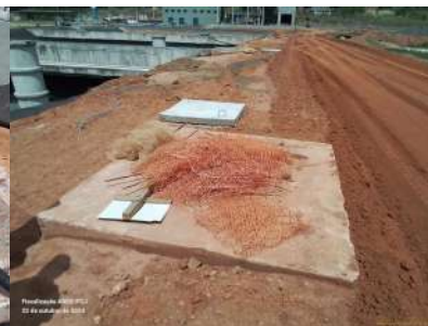
Foto 50 - EEE subterrânea de descarte de lodo do tanque 1B (etapa 2).
