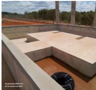
Foto 46 - Baía de contenção dos tanques de hipoclorito unidade B (etapa 2).
