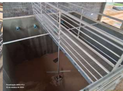
Foto 65 - Tanque de chegada de lodo da unidade B.
