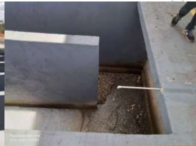
Foto 37 - Aplicação de hipoclorito de sódio no início do tanque de contato.
