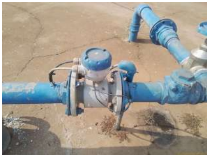
Foto 1 - Macromedidor instalado na tubulação do poço.
