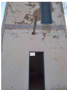
Foto 1 - Tralha improvisada para manutenção.
