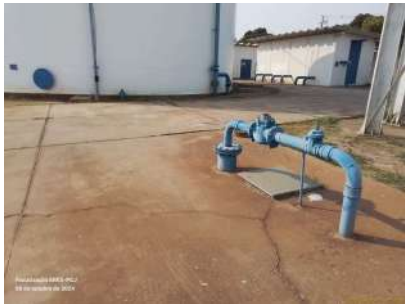
Foto 1 - Tampa de acesso à bomba.
