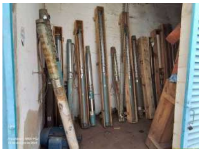
Foto 1 - Bombas reservas de poços.
