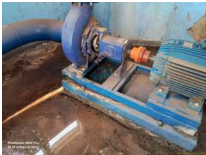
Foto 1 - Vazamento no selo mecânico.
