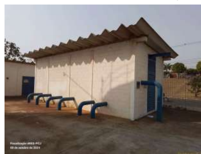
Foto 6 - Tubulações de sucção das EEAT.
