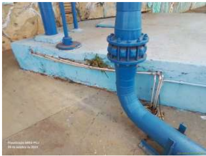
Foto 1 - Mangueiras de dosagem.
