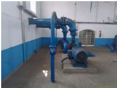
Foto 3 - Conjunto motobomba de uma das elevatórias presentes no local.
