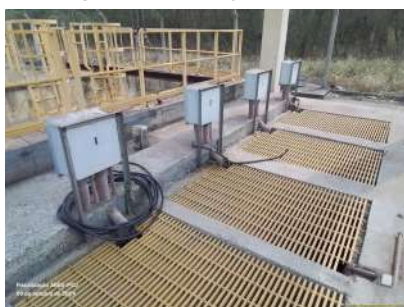
Foto 9 - Bombas da EEE.
