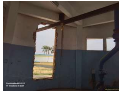
Foto 2 - Ausência de porta. Prestador informou a ocorrência de furtos no local.
