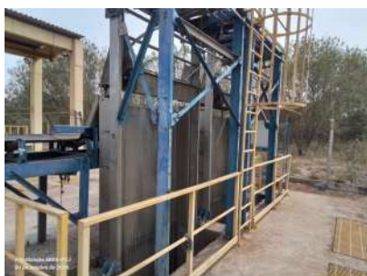
Foto 5 - Vista detalhada do gradeamento grosso.
