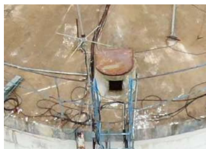
Foto 2 - Detalhe da tampa oxidada.
