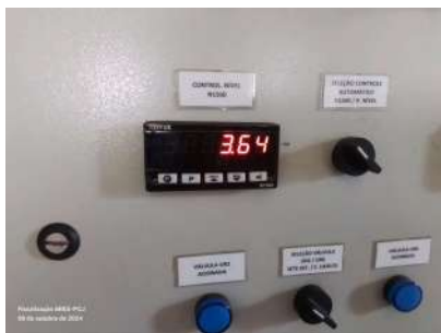
Foto 3 - Detalhe do painel de controle com a medição de nível.
