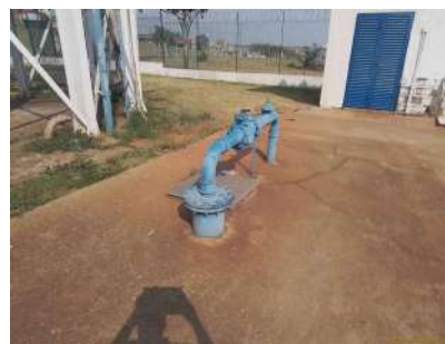
Foto 4 - Vista geral EEAT estilo "poço falso".
