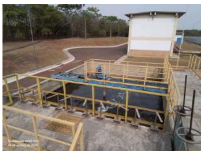
Foto 21 - Tanque 2 de desarenação.
