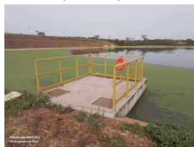
Foto 44 - Caixa de chegada do esgoto na lagoa de decantação.
