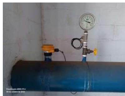
Foto 2 - Macro medidor na adutora para UR9.
