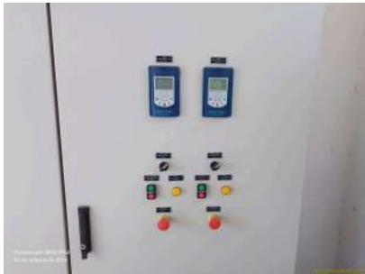
Foto 4 - Painel elétrico da EEA.
