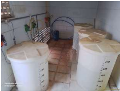
Foto 2 - À direita, na parte frontal, encontram-se dois tanques de hipoclorito, e ao fundo, à direita, está um tanque de ácido fluossilícico. À esquerda, há um tanque de ortopolifosfato.
