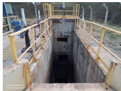
Foto 4 - Extravasores do poço de chegada situados a 6,5 m e 9m. O primeiro extravasor permanece fechado.
