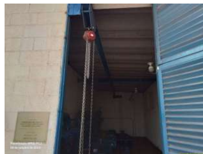
Foto 2 - Porta de acesso e trilho, trole e talha para içamento das bombas.
