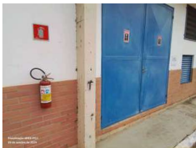
Foto 10 - Extintor de incêndio localizado no exterior da cabine de força.
