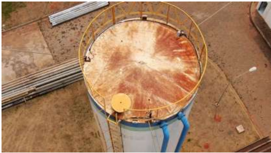
Foto 1 - Oxidação da estrutura metálica.
