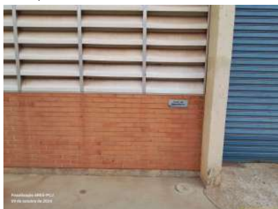
Foto 33 - Placa de identificação da casa dos sopradores
