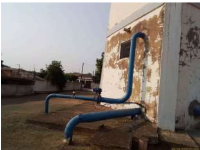
Foto 7 - Tubulações externas da EEA.
