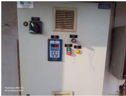
Foto 3 - Painel de controle do poço.
