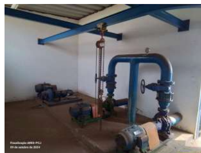
Foto 4 - Vista interna da EEA.
