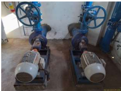
Foto 2 - Ausência de sistema de drenagem.
