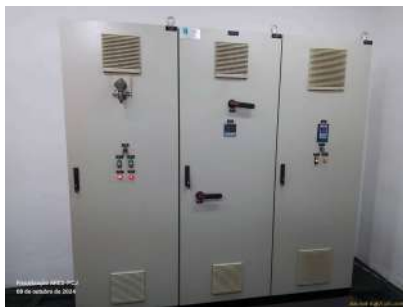
Foto 10 - Painéis elétricos da EEAT e poços da UC4.
