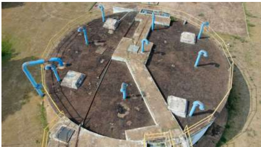
Foto 1 - Tubulações de ventilação.
