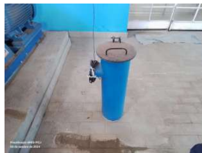
Foto 2 - Tubulação para medição de nível.
