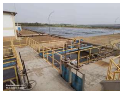
Foto 20 - Tanque 1 de desarenação.
