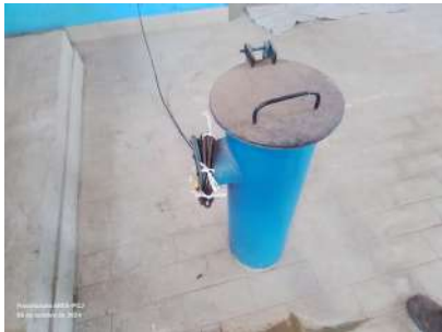
Foto 1 - Tubulação de ventilação do reservatório.
