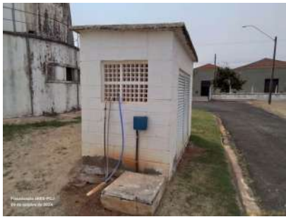
Foto 1 - Mangueiras para aplicação e dosagem de produtos químicos.
