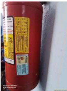
Foto 1 - Última manutenção realizada em fevereiro de 2024. Manutenções de 2° e 3° níveis previstas para 2025 e 2026, respectivamente.
