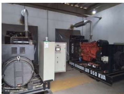
Foto 18 - Geradores da EEE.
