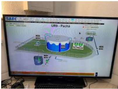
Foto 1 - Interface de monitoramento da unidade no CCO.
