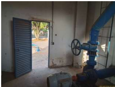
Foto 1 - EEA se encontra no interior de edificação de alvenaria, a qual é cercada por grades.
