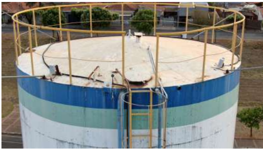
Foto 1 - Tubulação de ventilação sem tela de proteção.
