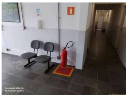
Foto 1 - Extintor de incêndio localizado na recepção do prédio administrativo.
