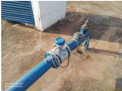
Foto 1 - Macromedidor instalado na tubulação do poço.
