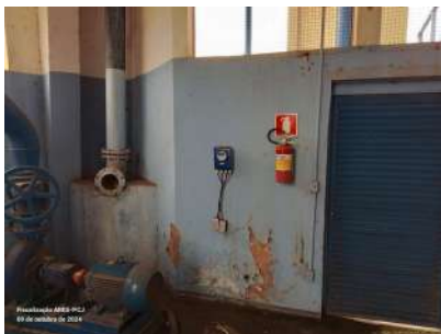
Foto 1 - Presença de extintor de incêndio no interior da edificação.
