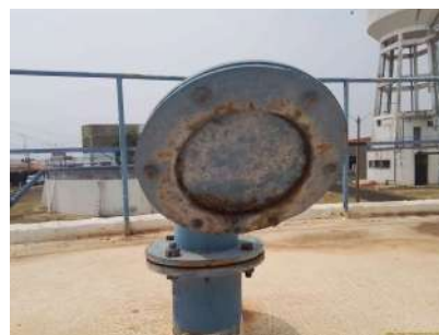
Foto 2 - Tela de proteção com camada de tinta do reservatório R2.
