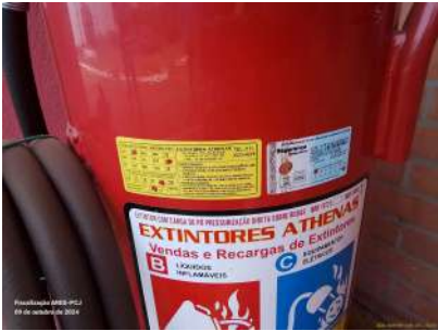
Foto 13 - Extintor de incêndio dos geradores com manutenção de 2º nível para 2025 e de 3º nível para 2028.
