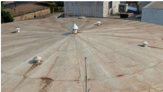
Foto 1 - Tubulação de ventilação.
