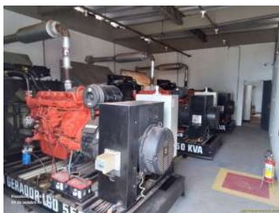
Foto 38 - Presença de 3 geradores de 550kva na ETE. A EEE também possui 2 geradores iguais.
