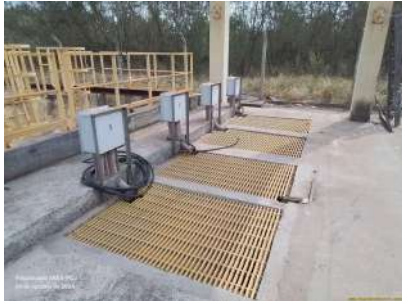
Foto 1 - Bombas em funcionamento e reservas.
