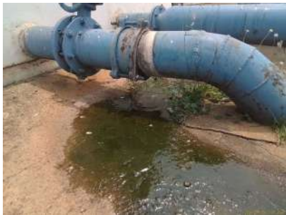
Foto 1 - Detalhe do vazamento na tubulação do reservatório R2.
