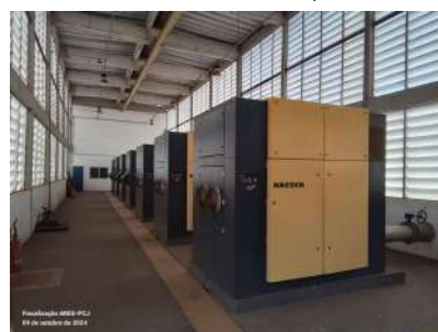
Foto 28 - Interior da casa dos sopradores, contendo 7 compressores.
