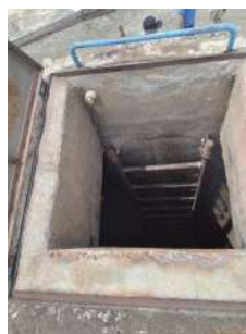
Foto 7 - Ausência de guarda-corpo na escada de acesso às válvulas do reservatório R1.
