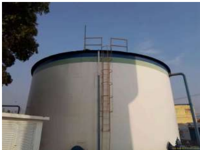
Foto 1 - Guarda-corpo no topo do reservatório com extensão insuficiente.
