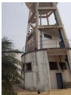
Foto 1 - Saída do tubo extravasor na base do reservatório.
