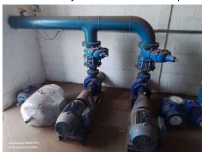
Foto 3 - Dois conjuntos moto bomba para UR9.
