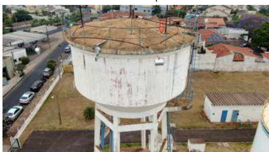
Foto 3 - Fita metálica do aterramento (seta).
