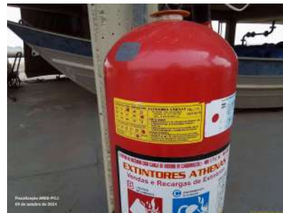
Foto 9 - Extintor do tratamento preliminar com manutenção de 2° nível para 2025 e de 3° nível para 2029.
