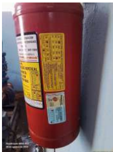
Foto 1 - Manutenções de 2° e 3° níveis previstas para 2025.
