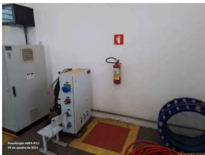
Foto 1 - Extintor de incêndio na edificação que abriga os painéis elétricos das bombas.
