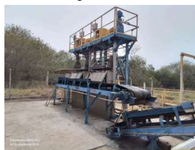
Foto 8 - Vista geral do sistema de gradeamento grosso.
