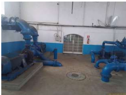
Foto 1 - Três conjuntos moto bomba.
