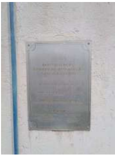
Foto 2 - Placa de identificação do reservatório.
