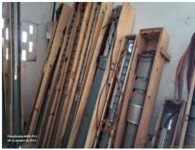
Foto 3 - Bombas reservas de poços.
