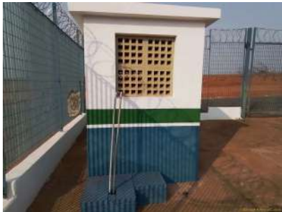
Foto 2 - Tubulação de aplicação dos produtos químicos na casa de química.
