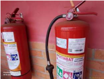
Foto 14 - Extintores de incêndio dos geradores com manutenção de 2º nível para 2025 e de 3º nível para 2028.
