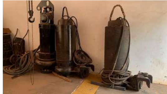
Foto 2 - Bombas reservas da EEE guardadas na casa de sopradores da ETE.
