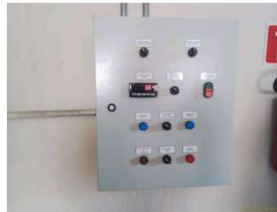
Foto 8 - Detalhe dos painéis elétricos da elevatória.
