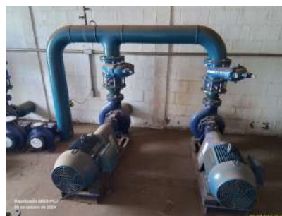
Foto 2 - Dois conjuntos moto bomba para UR7.
