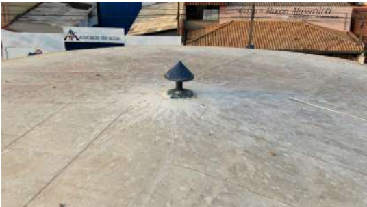
Foto 2 - Tubulação de ventilação do reservatório.
