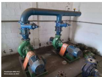
Foto 1 - Dois conjuntos moto bomba para UR6.
