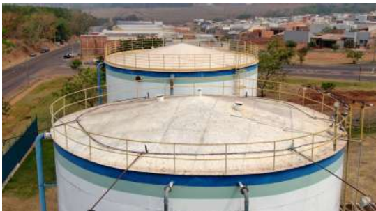
Foto 1 - Tubulações de ventilação sem tela de proteção.
