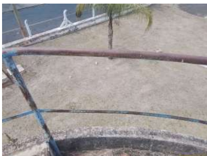
Foto 3 - Guarda-corpo do reservatório R1 sem pintura de proteção.
