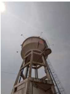
Foto 1 - Seta indicando local de vazamento.
