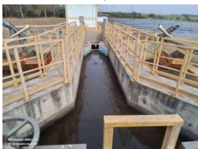
Foto 19 - Calha Parshall após gradeamento fino.
