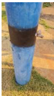
Foto 1 - Torneira de tomada de água do poço.
