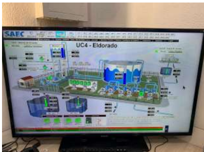
Foto 5 - Interface de monitoramento da unidade no CCO.
