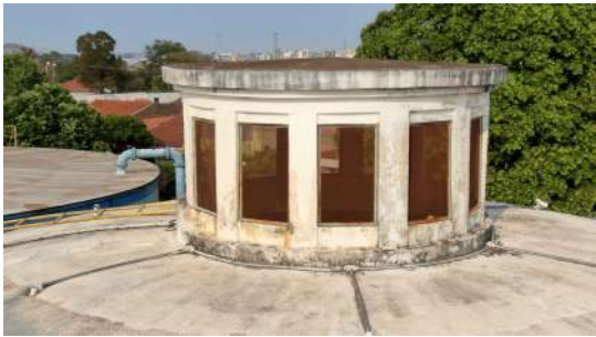
Foto 1 - Sistema de respiro com tela de proteção.
