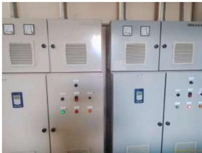
Foto 7 - Detalhe dos painéis elétricos da elevatória.
