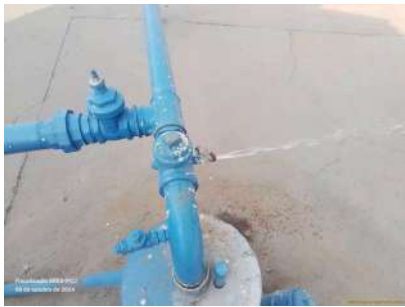
Foto 1 - Torneira para tomada de água bruta.
