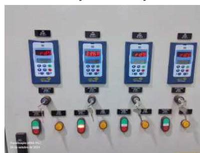
Foto 8 - Detalhe do painel elétrico.
