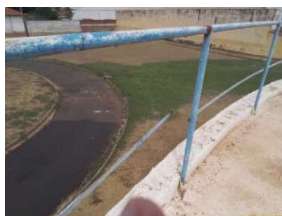
Foto 6 - Guarda-corpo danificado. Soldar.
