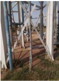
Foto 4 - Tubos de aplicação dos produtos químicos no reservatório elevado.
