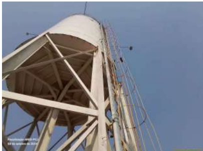
Foto 1 - Ausência de cabo de aterramento.
