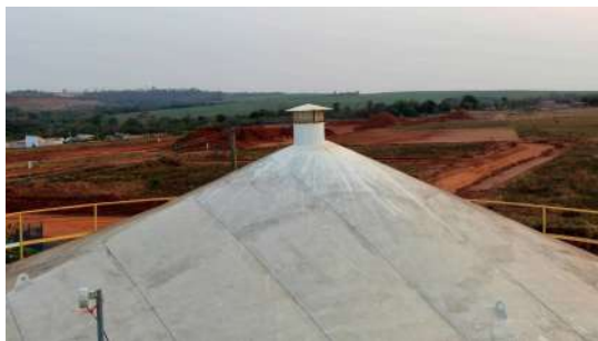
Foto 1 - Tubulação de ventilação com tela de proteção.
