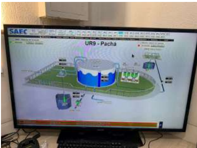
Foto 4 - Interface de monitoramento da unidade no CCO.
