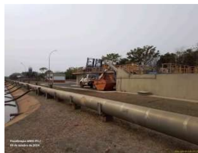
Foto 39 - Tubulação de ar das lagoas de aeração.
