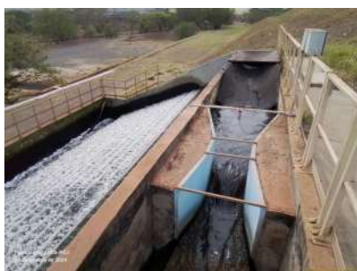
Foto 45 - Calha parshall de saída e escada hidráulica de pós-aeração.
