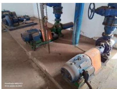
Foto 1 - Dois conjuntos moto bomba.
