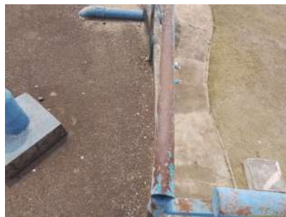
Foto 2 - Detalhe do guarda-corpo do reservatório R1 sem pintura de proteção.
