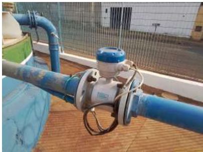
Foto 1 - Macromedidor instalado na tubulação do poço.
