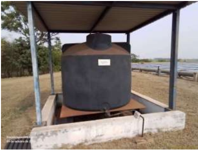
Foto 9 - Tanque de armazenamento de diesel dos geradores.
