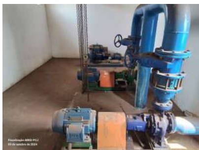
Foto 3 - Vista interna da EEA.
