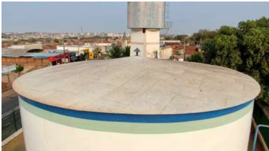
Foto 1 - Tubulação de ventilação do reservatório.
