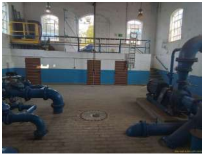
Foto 5 - Vista geral do interior da edificação que abriga as elevatórias de água.
