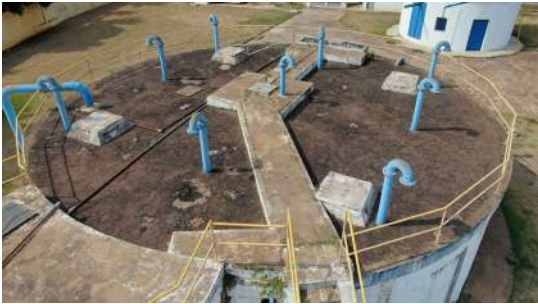
Foto 1 - Tubulações de respiro.
