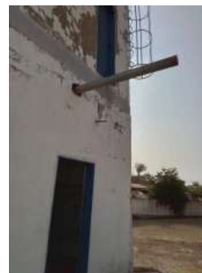
Foto 2 - Tralha improvisada para manutenção.
