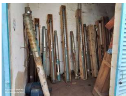
Foto 1 - Bombas reservas de poços.
