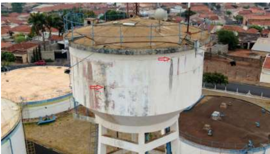
Foto 2 - Setas indicando vazamento em fissuras da estrutura de concreto.
