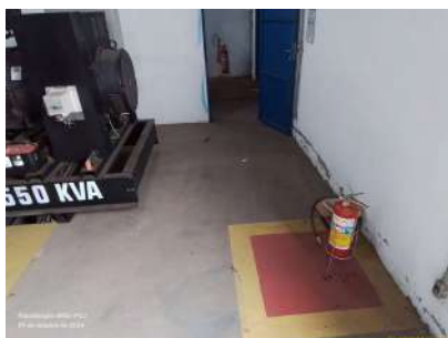
Foto 5 - Extintor de incêndio na edificação que abriga os geradores.
