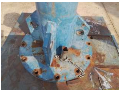
Foto 1 - Tubo de medição de nível do poço P1.
