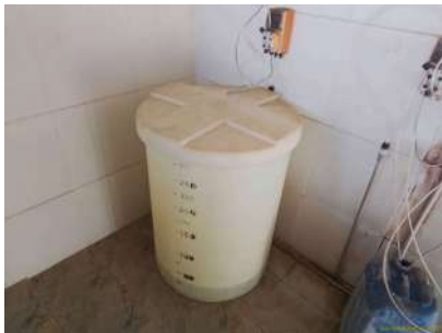
Foto 2 - Tanque de armazenamento e dosagem de ortopolifosfato para controle de carbonato na água.
