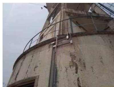
Foto 2 - Fita metálica do aterramento.
