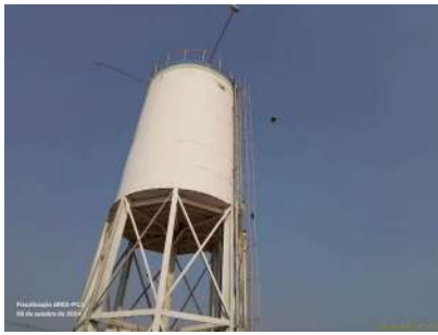
Foto 1 - Tubo extravasor do reservatório.
