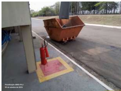
Foto 8 - Extintor de incêndio localizado no tratamento preliminar.
