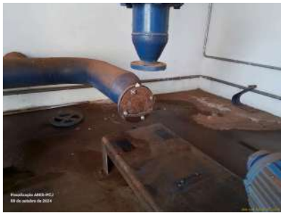
Foto 1 - Acúmulo de água no interior da EEA.
