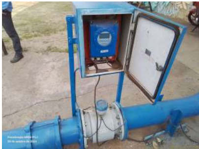
Foto 1 - Macromedidor do poço.
