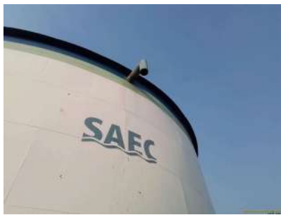
Foto 1 - Tubo extravasor sem tela de proteção.
