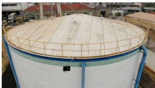
Foto 1 - Tubos de ventilação sem tela de proteção.
