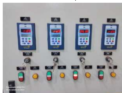
Foto 9 - Detalhe do painel elétrico.
