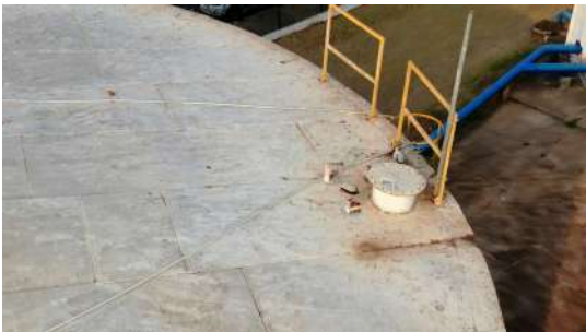
Foto 2 - Guarda-corpo no topo do reservatório não abrange a tampa.
