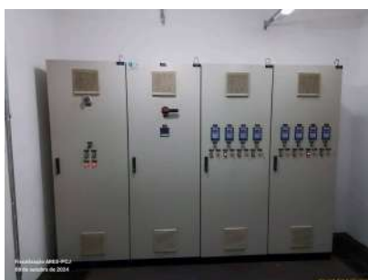
Foto 7 - Painéis elétricos da EEAT e poços da UC4.
