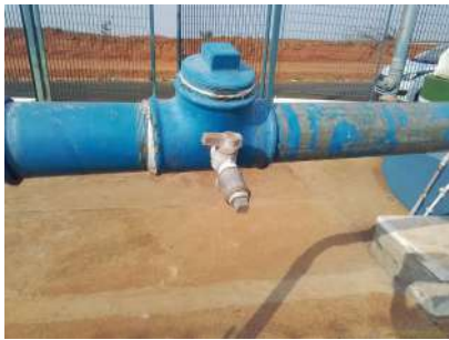
Foto 1 - Torneira de tomada de água bruta, porém vedada.
