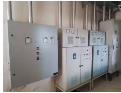
Foto 6 - Painéis elétricos das elevatórias de água, localizado em sala ao lado do local onde se situam as bombas.
