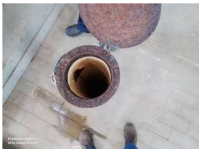
Foto 1 - Tubulação para medição de nível.
