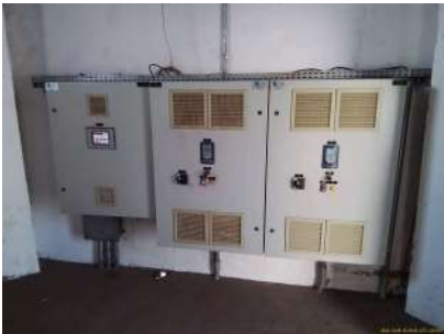
Foto 4 - Painéis elétricos da EEA.
