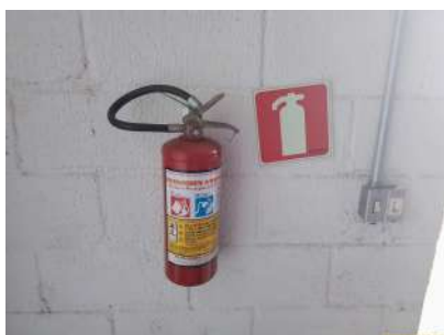
Foto 1 - Extintor de incêndio no interior da edificação que abriga a elevatória de água.
