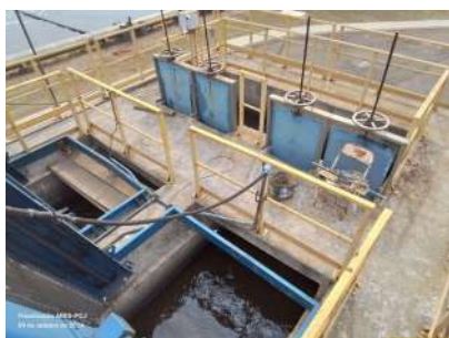
Foto 17 - Tanques de chegada de esgoto bruto no tratamento preliminar.
