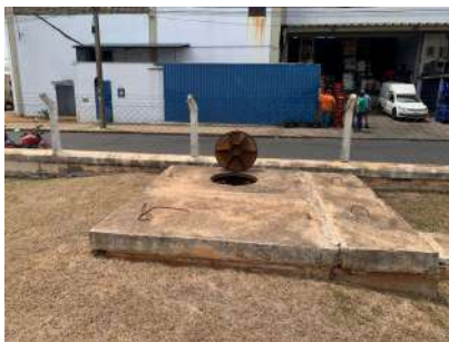
Foto 10 - Ausência de escada e guarda-corpo para acessar a válvula que abastece o bairro.
