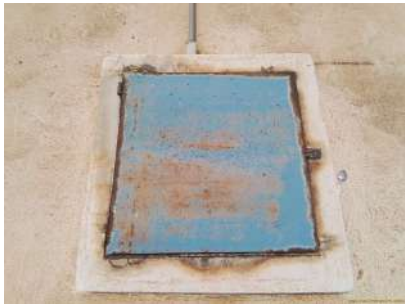
Foto 1 - Tampa oxidada do reservatório R2.
