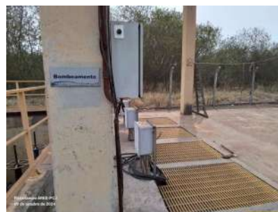
Foto 12 - Local onde se localizam as bombas.
