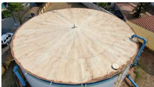
Foto 1 - Tubulações de ventilação.
