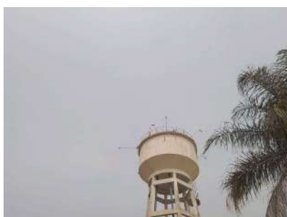
Foto 1 - Para-raios no topo do reservatório.
