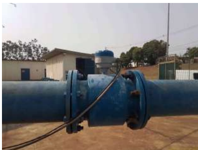
Foto 1 - Macromedidor do poço.
