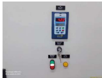
Foto 11 - Detalhe do painel elétrico.
