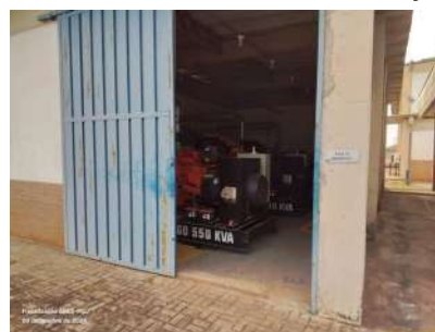
Foto 37 - Acesso ao local que abriga os geradores.
