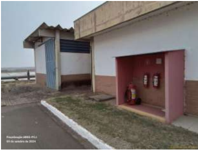
Foto 12 - Extintores de incêndio localizados próximos ao prédio dos geradores.
