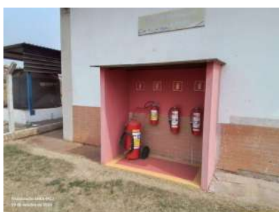
Foto 9 - Extintores de incêndio no exterior do prédio que abriga os geradores, próximos ao tanque de combustível.
