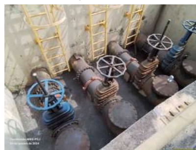
Foto 10 - Tubulações e válvulas das 4 bombas da EEE.
