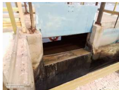
Foto 40 - Caixa de distribuição do esgoto para as lagoas de aeração.
