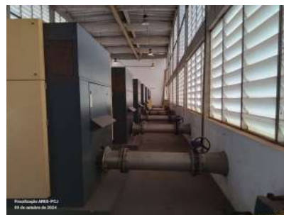
Foto 32 - Vista dos sopradores e das tubulações de ar.
