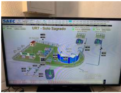
Foto 8 - Interface de monitoramento da unidade no CCO.
