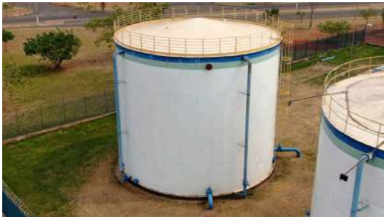
Foto 1 - Tubulação de ventilação no topo.
