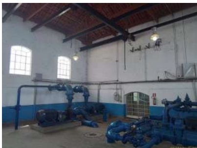
Foto 1 - Elevatórias se encontram no interior de edifício de alvenaria.
