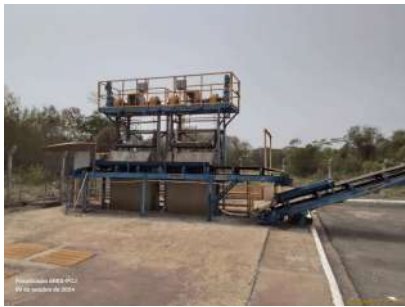
Foto 1 - Vista geral do sistema de gradeamento grossoiro.
