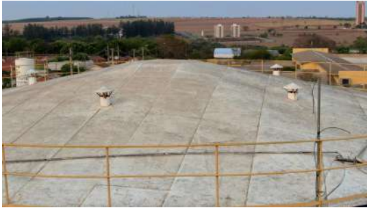
Foto 1 - Tubulação de ventilação sem telas de proteção.
