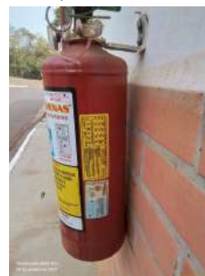
Foto 11 - Extintor de incêndio da cabine de força com manutenção de 2° nível para 2025 e de 3° nível para 2026.
