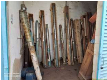
Foto 1 - Bombas reservas de poços.
