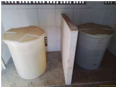
Foto 1 - Tanques de armazenamento e dosagem de Hipoclorito de Sódio e Ácido Fluossilícico.
