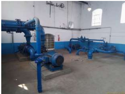
Foto 1 - Vista geral das duas elevatórias de água, uma à direita e outra à esquerda da imagem.
