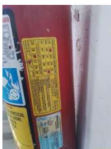
Foto 1 - Manutenção de 2º nível prevista para 2025 e manutenção de 3º nível prevista para 2026.
