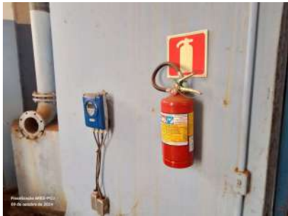
Foto 1 - Extintor de incêndio na EEA.
