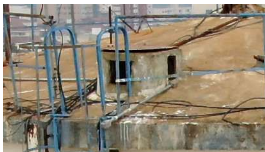
Foto 2 - Detalhe das duas aberturas de ventilação sem tela de proteção.
