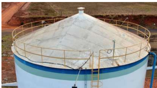
Foto 1 - Tubulação de ventilação do reservatório.
