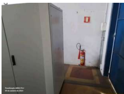
Foto 7 - Extintor de incêndio no local dos painéis elétricos dos geradores.
