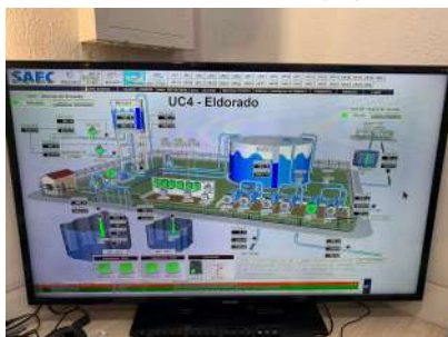
Foto 15 - Interface de monitoramento da unidade no CCO
