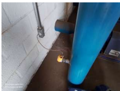
Foto 3 - Macro medidor na adutora para UR7.
