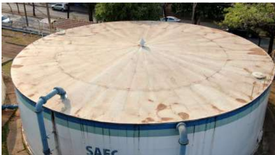
Foto 1 - Tampas de inspeção.
