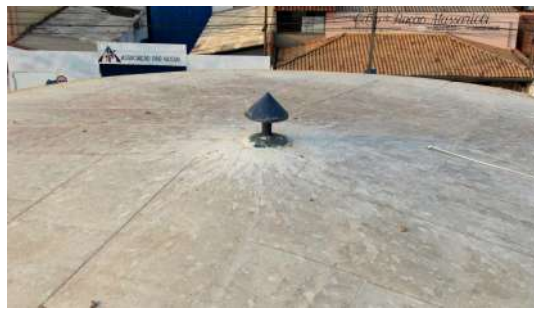
Foto 2 - Tubulação de ventilação com proteção.
