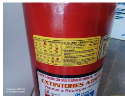
Foto 2 - Extintor da recepção com manutenção de 2º nível para 2025 e de 3º nível para 2029.
