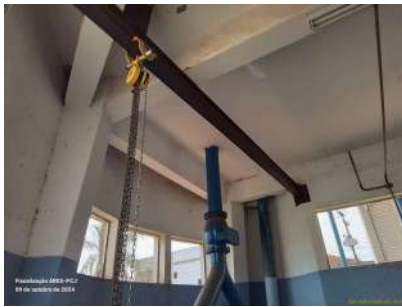
Foto 1 - Trilho, trole e talha para içamento das bombas.
