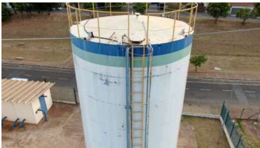
Foto 1 - Tubulação de ventilação do reservatório.
