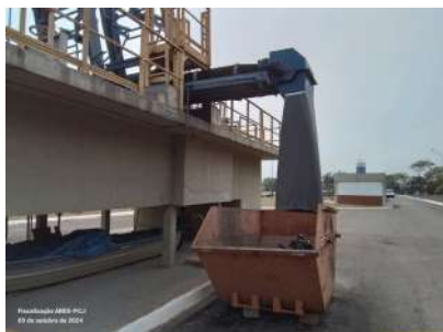
Foto 14 - Caçamba que recebe material retirados no gradeamento fino.
