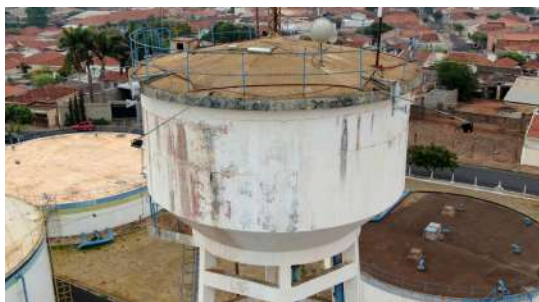
Foto 1 - Ventilação (topo do reservatório, à esquerda) sem tela de proteção.
