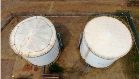
Foto 2 - Vista geral dos reservatórios apoiados. À esquerda apoiado 1 e à direita apoiado 2.
