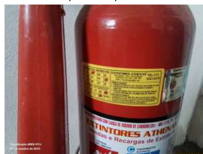
Foto 8 - Extintor dos painéis elétricos dos geradores: próxima manutenção de 2º nível prevista para 2025 e de 3º nível prevista para 2029.
