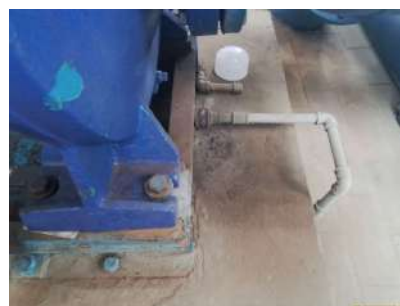
Foto 2 - Tubulação para conduzir a água de lubrificação.
