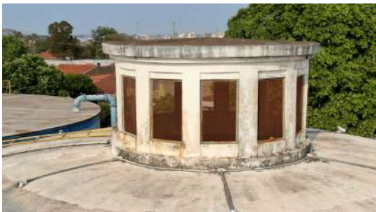
Foto 1 - Sistema de ventilação.
