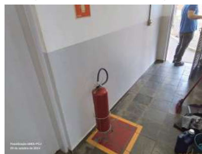
Foto 4 - Extintor de incêndio localizado no corredor do prédio administrativo.
