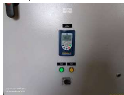
Foto 15 - Detalhe do painel elétrico.
