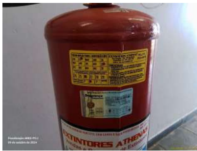
Foto 5 - Extintor de incêndio do corredor com manutenção de 2° nível para 2025 e de 3° nível para 2026.
