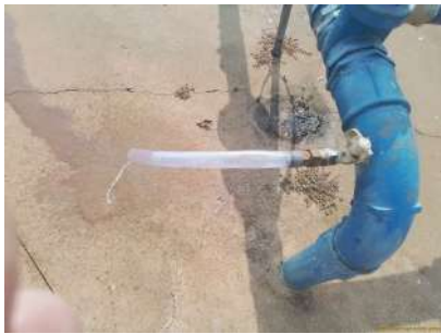
Foto 1 - Torneira de tomada de água do poço 2 em funcionamento.
