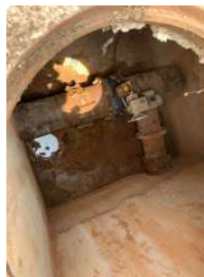
Foto 11 - Ausência de escada e guarda-corpo para acessar a válvula que abastece o bairro.
