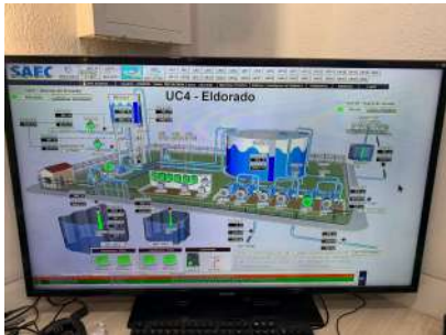
Foto 3 - Interface de monitoramento da unidade no CCO.
