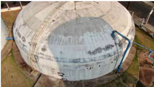
Foto 1 - Escada de acesso ao topo sem guarda-corpo.
