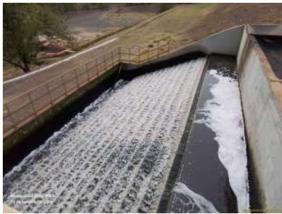
Foto 47 - Escada hidráulica de pós-aeração.
