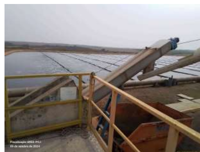
Foto 22 - Sistema de retirada de areia dos tanque de desarenação.
