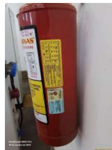
Foto 2 - Extintor dos painéis elétricos: próxima manutenção de 2º nível prevista para 2025 e de 3º nível prevista para 2026.
