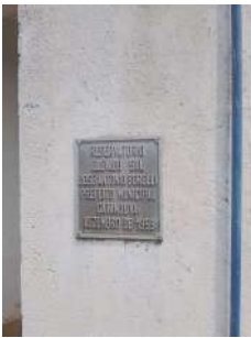
Foto 1 - Placa de identificação do reservatório.
