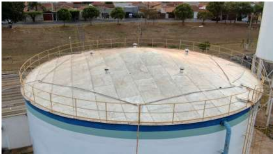
Foto 1 - Tubulações de ventilação do reservatório.
