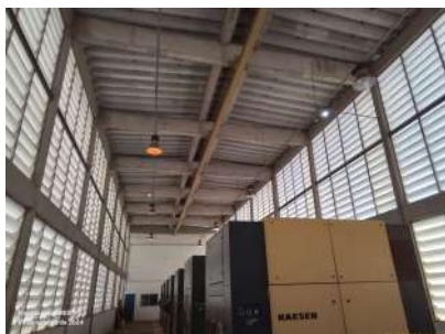
Foto 31 - Viga no teto da casa dos sopradores para deslocamento da talha.
