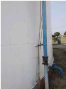
Foto 6 - Mangueiras de aplicação dos produtos químicos no reservatório apoiado.
