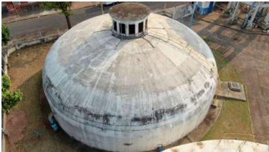
Foto 1 - Tampa de inspeção junto ao sistema de respiro.
