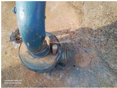
Foto 1 - Torneira de tomada de água bruta em funcionamento.
