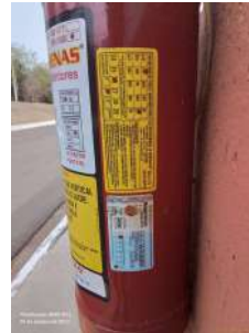
Foto 7 - Extintor da oficina com manutenção de 2° nível para 2025 e de 3° nível para 2026.
