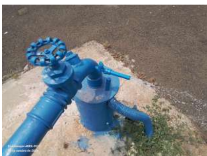
Foto 1 - Torneira de tomada de água funcionando.
