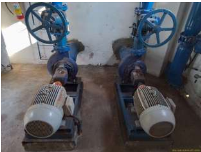
Foto 5 - Conjunto motobomba da EEA.
