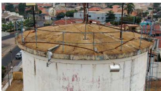
Foto 1 - Tampa de inspeção oxidada.
