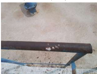
Foto 5 - Detalhe do guarda-corpo do reservatório R2 sem pintura de proteção.
