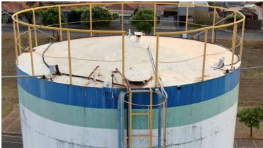
Foto 1 - Base da tampa com corrosão.
