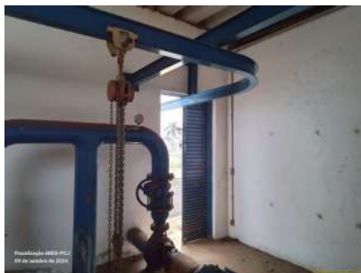
Foto 1 - Porta de acesso e trilho, trole e talha para içamento das bombas.
