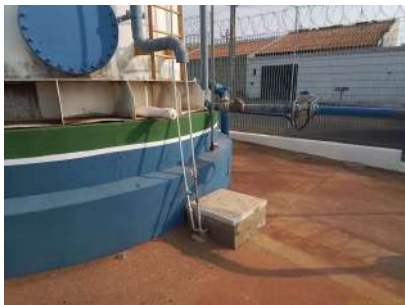
Foto 3 - Tubulação de aplicação dos produtos químicos no reservatório.
