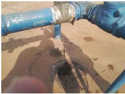
Foto 1 - Vazamento na tubulação do poço.
