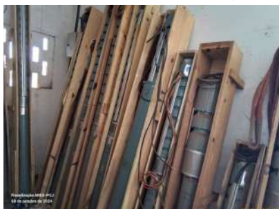
Foto 3 - Bombas reservas de poços.
