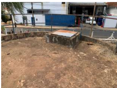
Foto 8 - Ausência de guarda-corpo na escada de acesso às válvulas do reservatório R1.
