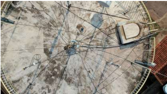
Foto 1 - Captor Franklin no topo do reservatório.
