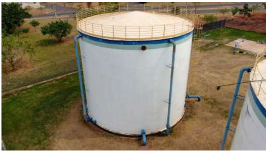
Foto 1 - Tubo extravasor à esquerda.
