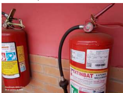
Foto 11 - Extintores externos: próximas inspeções de 2º nível para 2025 e de 3º nível para 2027 e 2028.
