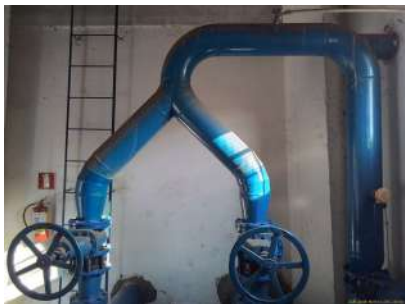
Foto 6 - Recalque da EEA.
