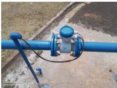
Foto 1 - Macromedidor instalado na tubulação do poço.
