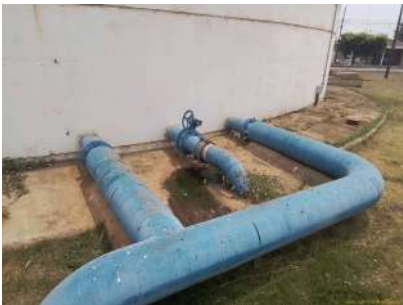
Foto 2 - Tubulação do reservatório R2 com vazamento.
