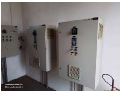
Foto 1 - Painel elétrico da EEA.
