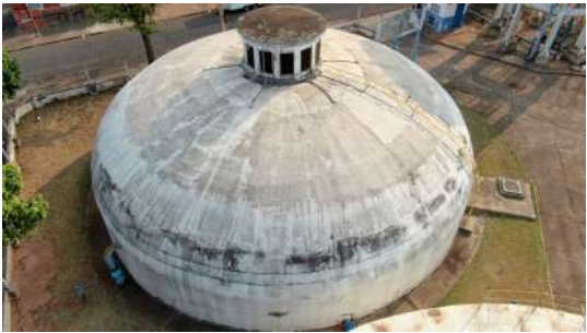
Foto 2 - Sistema de respiro com tela de proteção.
