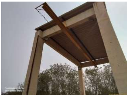
Foto 2 - Ausência de talha. O içamento das bombas é feito com caminhão munk quando necessário e sob agendamento prévio.
