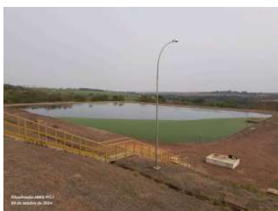
Foto 41 - Vista geral da lagoa de decantação 1.
