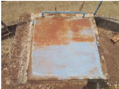
Foto 2 - Tampa oxidada do reservatório R1.
