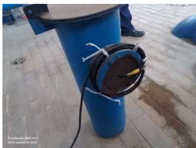
Foto 1 - Tela de proteção na tubulação de ventilação.
