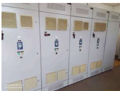
Foto 14 - Painéis elétricos da EEE.
