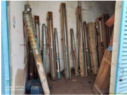
Foto 1 - Bombas reservas de poços.
