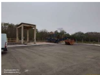
Foto 1 - Vista geral da EEE.
