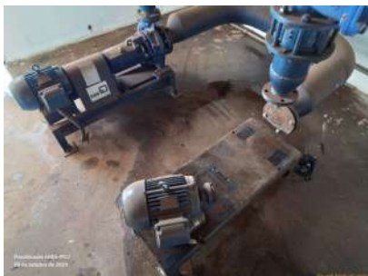
Foto 1 - Bomba reserva em falta na EEA.
