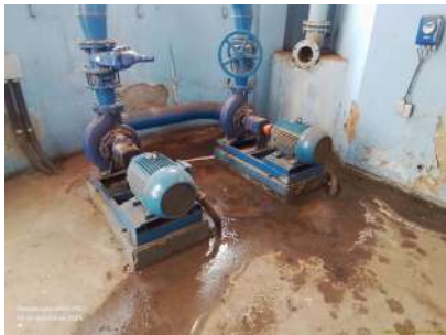
Foto 2 - Piso da EEA molhado devido ao vazamento.
