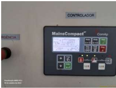
Foto 20 - Detalhe do painel de controle do gerador da EEE.
