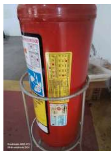
Foto 6 - Extintor dos geradores: próxima manutenção de 2º nível prevista para 2025 e de 3º nível prevista para 2026.
