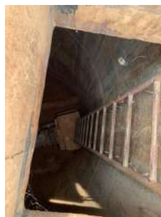
Foto 9 - Ausência de guarda-corpo na escada de acesso às válvulas do reservatório R1.
