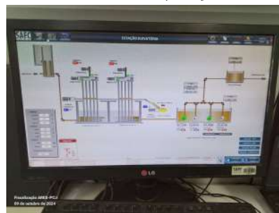
Foto 7 - Interface de controle e operação da ETE.
