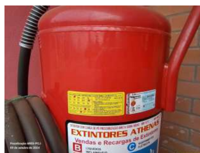
Foto 10 - Extintores externos: manutenção de 2º nível prevista para 2025 e de 3º nível prevista para 2028.
