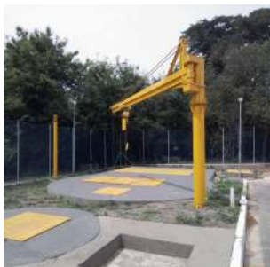
Foto 1 - Instalação para içamento e manutenção das bombas.
