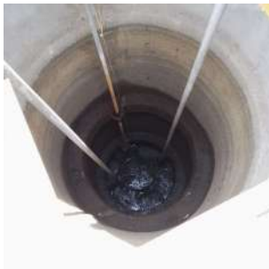
Foto 3 - Poço de sucção da elevatória.
