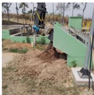
Foto 12 - Equipamentos para remoção de sólidos no tratamento preliminar.
