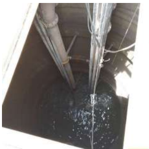
Foto 9 - Poço de sucção com duas bombas.
