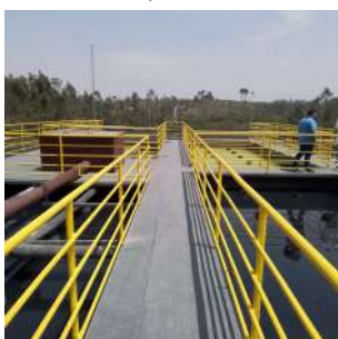
Foto 3 - Guarda-corpos no reator.
