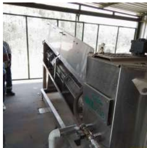
Foto 2 - Skid para tratamento de lodo.
