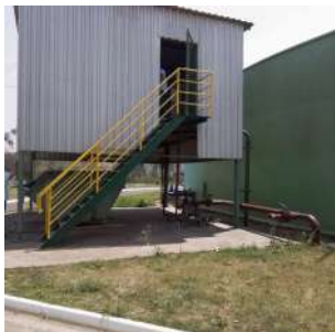
Foto 1 - Unidade para tratamento do lodo.
