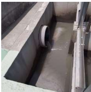
Foto 5 - Chegada do efluente na estação de tratamento.
