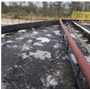
Foto 8 - Filtros aeróbios da ETE.
