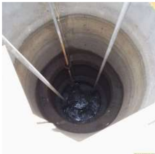
Foto 1 - Cesto peneira no poço úmido.
