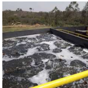
Foto 9 - Reator da ETE.
