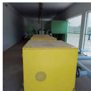
Foto 25 - Sopradores à frente; ao fundo sistema de desinfecção com tecnologia que utiliza radiação ultravioleta. Na ocasião da fiscalização, a desinfecção ainda não estava sendo realizada.
