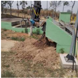
Foto 1 - Necessário realizar limpeza recorrente do material removido no tratamento preliminar.
