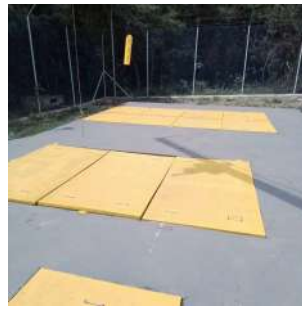
Foto 2 - Poços da elevatória.
