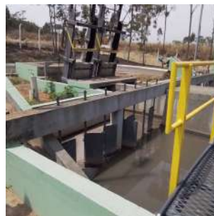
Foto 6 - Tratamento preliminar da ETE.
