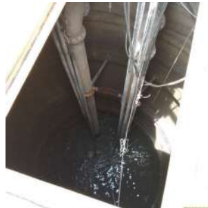
Foto 8 - Poço de sucção com duas bombas.
