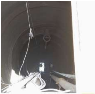
Foto 7 - Poço de sucção com duas bombas.
