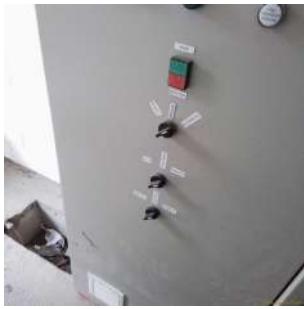
Foto 1 - Painel de comando das bombas: duas instaladas no poço de sucção.
