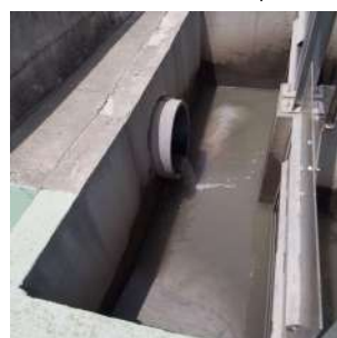
Foto 6 - Chegada do efluente à ETE.
