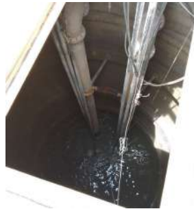
Foto 2 - Verificou-se que a elevatória está em funcionamento.
