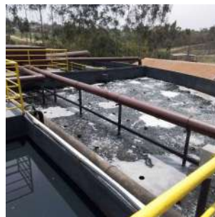
Foto 7 - Etapa aeróbia do tratamento.
