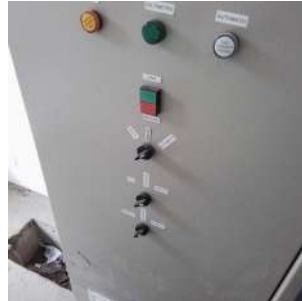
Foto 4 - Painel de comando das bombas.
