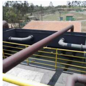
Foto 20 - Um dos decantadores.
