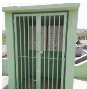
Foto 14 - Painel de comando de equipamentos do tratamento preliminar.
