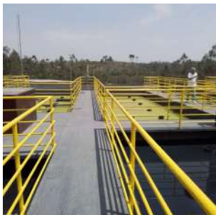
Foto 3 - Guarda-corpos no reator.
