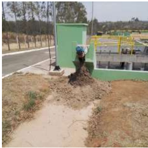
Foto 2 - Material acumulado, removido pelo tratamento preliminar.
