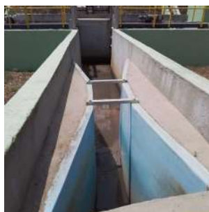
Foto 2 - Calha parshall após tratamento preliminar.
