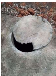
Foto 6 - Verificou-se escoamento de esgoto no PV
