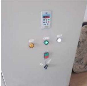
Foto 3 - Painel de comando das bombas.
