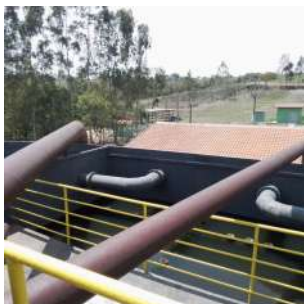
Foto 21 - Tubulação de entrada do efluente no reator.
