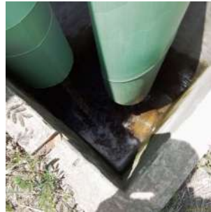
Foto 29 - Saída do efluente após desinfecção.
