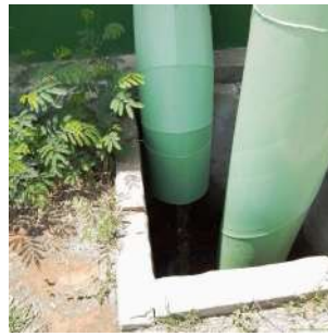
Foto 27 - Saída do efluente após passar pelo sistema de desinfecção. Como o processo não está ocorrendo, o efluente passava por um by pass.
