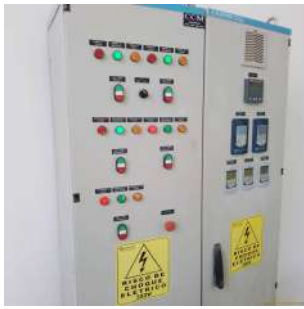
Foto 26 - Painel de comando dos sopradores.
