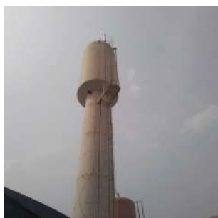
Foto 1 - Guarda-corpo na escada de acesso
