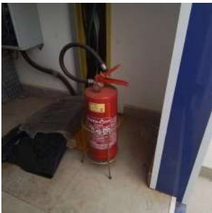
Foto 1 - Extintor de incêndio
