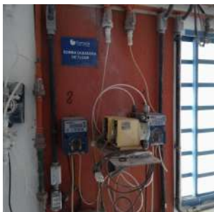
Foto 1 - Bomba dosadora de flúor
