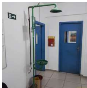
Foto 2 - Chuveiro de emergência
