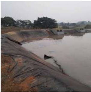
Foto 1 - Revestimento da lagoa de aeração rompido
