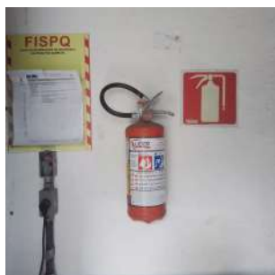
Foto 1 - Extintor de incêndio
