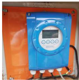
Foto 2 - Display macromedidor ETA I
