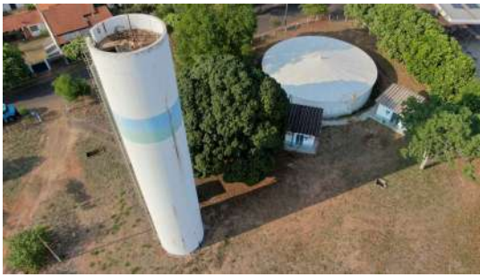
Foto 1 - Vista da área dos reservatórios Bonanza
