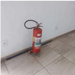
Foto 1 - Extintor de incêndio
