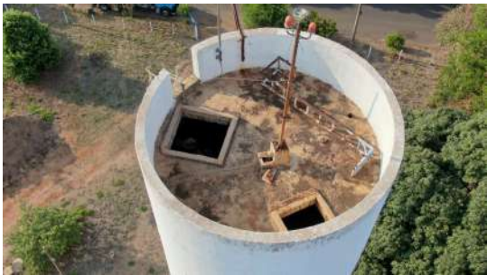
Foto 1 - Reservatório sem tampas no dia da fiscalização.
