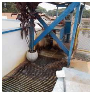
Foto 2 - Chegada de água bruta ETA II
