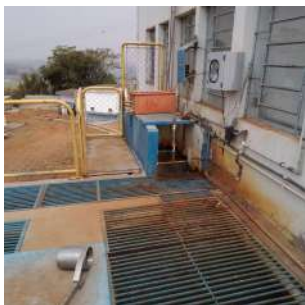
Foto 1 - Chegada de água bruta ETA I
