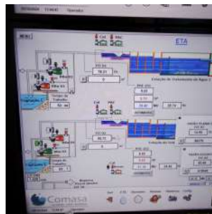
Foto 6 - Tela do CCO com vazões de entrada ETA 1 e ETA 2
