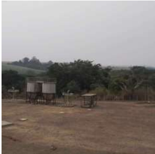
Foto 8 - Sistema de desidratação de lodo (fora de operação)
