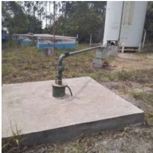
Foto 2 - Cavalete do poço de cima Santa Cruz da Estrela
