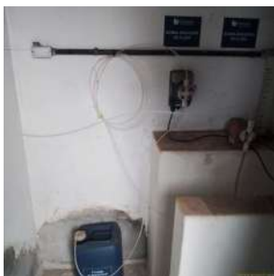
Foto 1 - Armazenamento e dosagem de cloro e flúor
