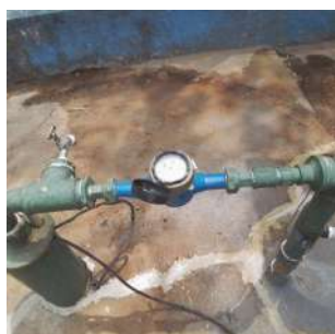
Foto 1 - Macromedidor instalado no cavalete do poço
