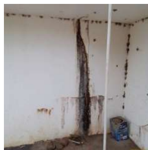
Foto 2 - Vazamento parede ETA 1
