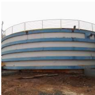
Foto 1 - Reservatório central ETA
