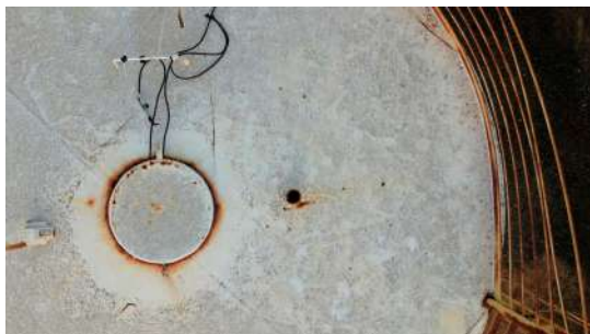
Foto 1 - Tubulação de ventilação sem tela de proteção.
