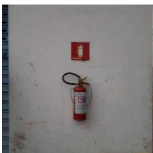
Foto 1 - Extintor de incêndio
