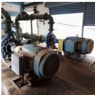
Foto 1 - Conjuntos motobomba, com reserva
