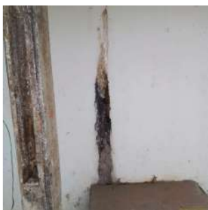
Foto 1 - Vazamento parede ETA 1
