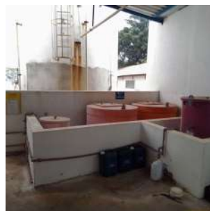
Foto 2 - Estocagem de produtos químicos, com bacia de contenção
