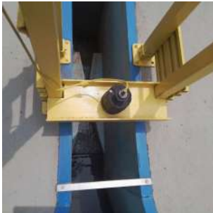
Foto 2 - Macromedidor de vazão
