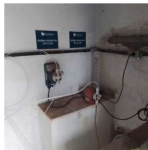
Foto 2 - Bombas dosadoras de cloro e flúor
