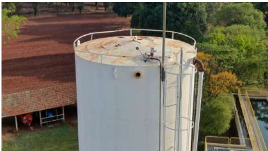
Foto 1 - Extravasor sem tela de proteção.
