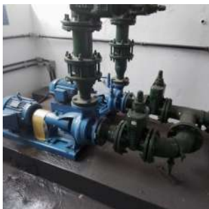
Foto 1 - Conjunto motobomba reserva
