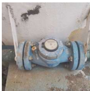
Foto 2 - Macromedidor na saída do reservatório
