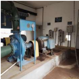
Foto 2 - Vista interna da EEAT junto a ETA
