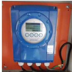
Foto 4 - Display macromedidor ETA I
