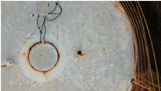
Foto 1 - Tampa de inspeção e tubulação de ventilação.
