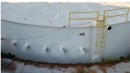
Foto 1 - Ausência de tela de proteção no extravasor
