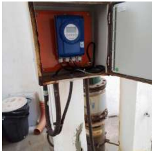
Foto 3 - Macromedidor entrada ETA 2
