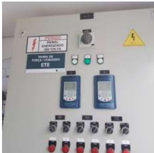
Foto 3 - Painel de comando e controle
