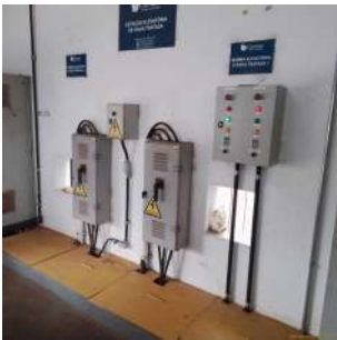
Foto 3 - Painele de comando e controle
