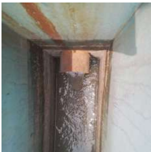
Foto 2 - Chegada esgoto bruto
