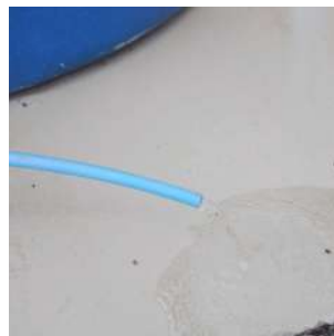
Foto 6 - Saída esgoto tratado
