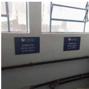
Foto 1 - Placa de identificação
