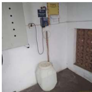
Foto 1 - Armazenamento e dosagem de flúor
