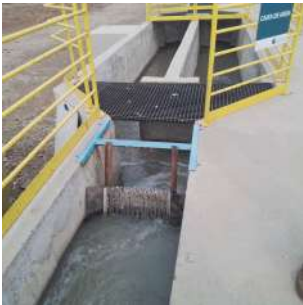
Foto 3 - Vista do gradeamento
