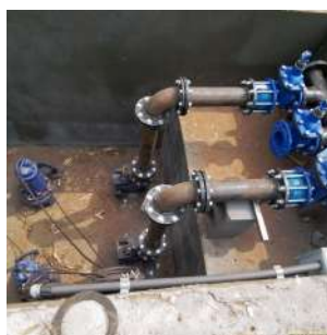
Foto 10 - Equipamentos do sistema de desidratação do lodo
