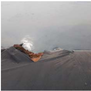
Foto 2 - Detalhe da manta rompida
