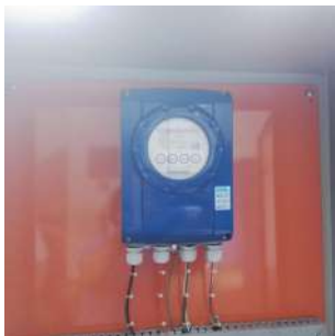
Foto 3 - Display do macromedidor
