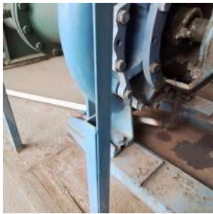
Foto 1 - Drenagem de água de lubrificação de gaxeta
