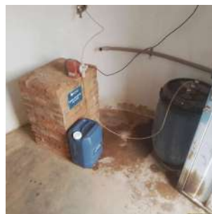
Foto 2 - Armazenamento e dosagem de cloro
