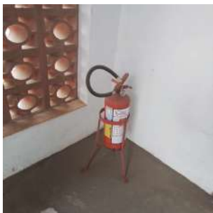
Foto 1 - Extintor de incêndio
