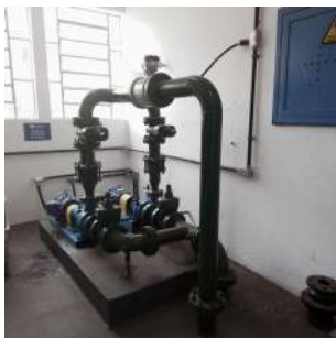
Foto 1 - EEAT Recalque 22 de maio
