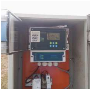
Foto 1 - Visor do medidor de vazão
