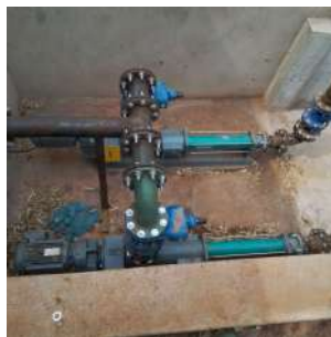
Foto 6 - Equipamentos do sistema de desidratação do lodo
