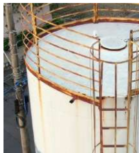
Foto 2 - Tubo extravasor sem tela de proteção.
