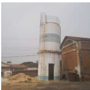
Foto 1 - Reservatório Santa Cruz da Estrela (Praça)
