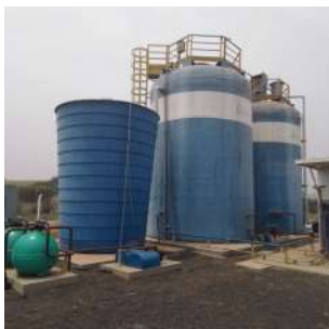
Foto 5 - UASB e biofiltro
