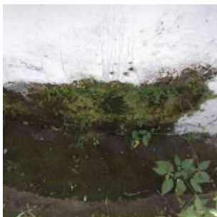
Foto 3 - Vazamento na parede traseira do reservatório.
