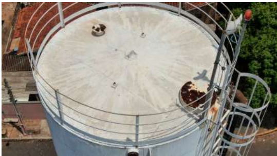
Foto 1 - Tampa de inspeção oxidada.
