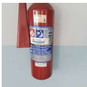
Foto 1 - Extintor de incêndio.
