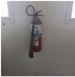
Foto 1 - Extintor de incêndio.
