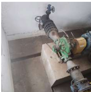
Foto 1 - Drenagem da lubrificação da gaxeta.
