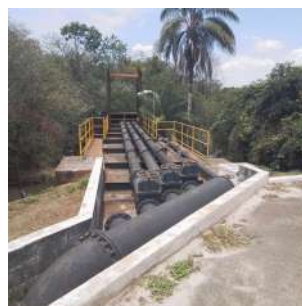
Foto 4 - Tubulação de Recalque E.E.A.B. 01.
