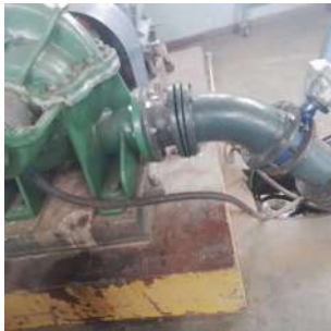
Foto 1 - Drenagem da lubrificação da gaxeta.
