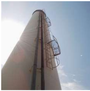
Foto 1 - Escada tipo marinheiro e passarelas de descanso com guarda-corpo.
