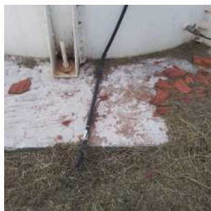
Foto 1 - Cabo com aterramento do SPDA.
