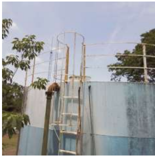
Foto 1 - Escada e guarda corpo do reservatório.
