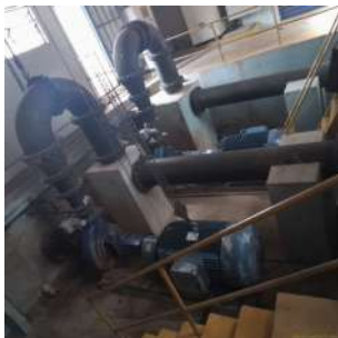
Foto 1 - Conjunto motobomba da captação reserva.
