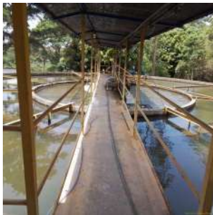
Foto 1 - Guarda-corpos da passarela.
