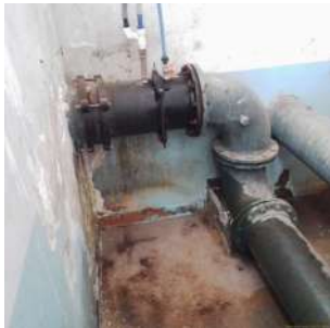
Foto 1 - Vazamento no TAP da tubulação de saída da ETA I.
