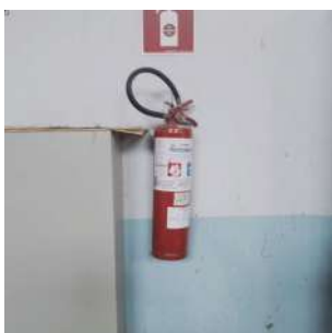
Foto 1 - Extintor de incêndio.
