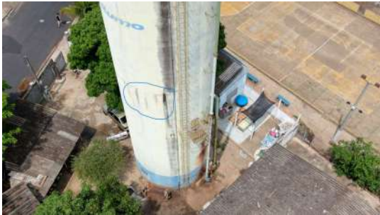
Foto 1 - Pontos de vazamento.
