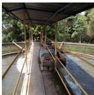
Foto 2 - Calha e floculador.
