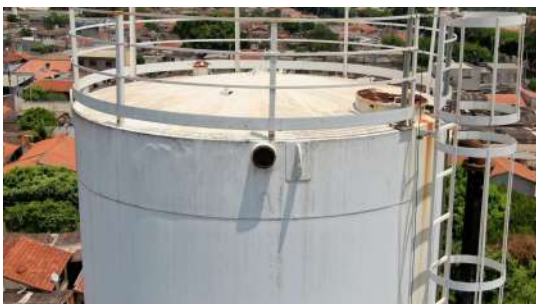
Foto 1 - Tubo extravasor sem tela de proteção.
