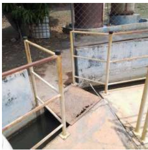
Foto 1 - Passarela em más condições.
