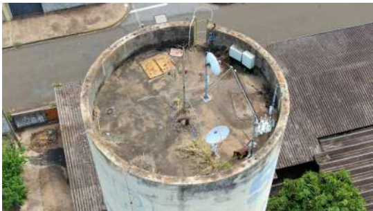
Foto 1 - Vegetação crescendo na laje.
