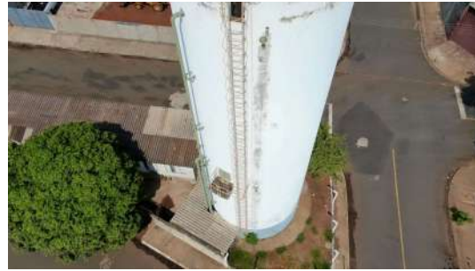
Foto 2 - Dois extravasores sem tela de proteção instalada.
