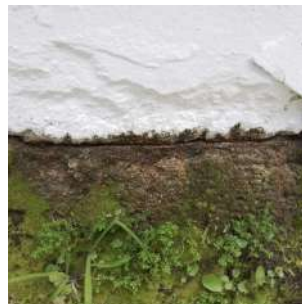
Foto 2 - Imagem ampliada do vazamento na parede frontal.
