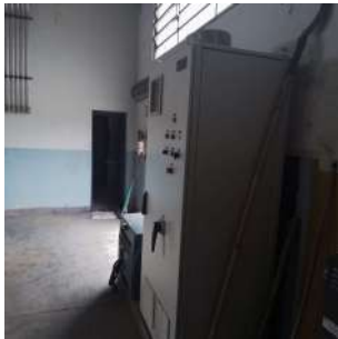
Foto 3 - Painéis de controle.
