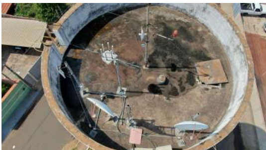
Foto 1 - Tampa de inspeção parcialmente aberta.
