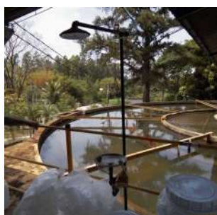
Foto 1 - Chuveiro de emergência.
