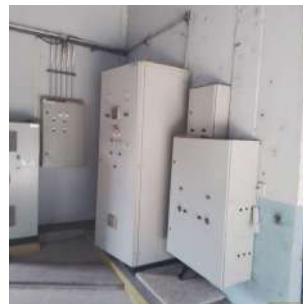
Foto 2 - Painéis de controle da captação reserva.
