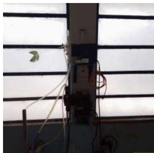
Foto 1 - Bomba dosadora de flúor.
