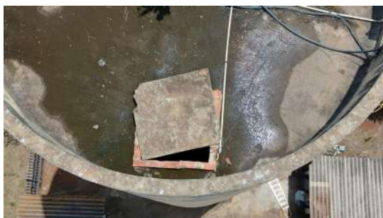
Foto 1 - Tampa de inspeção aberta.
