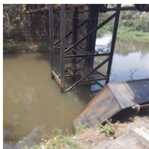
Foto 3 - Sucção de água bruta com bombas anfíbias submersas.
