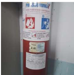
Foto 1 - Validade do extintor de incêndio.
