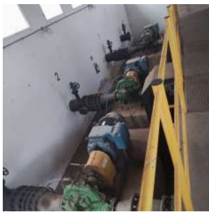
Foto 6 - Conjuntos motobombas da E.E.A.B. 02.
