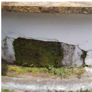
Foto 1 - Vazamento na parede frontal do reservatório.
