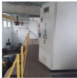
Foto 7 - Painéis de controle da E.E.A.B. 02.
