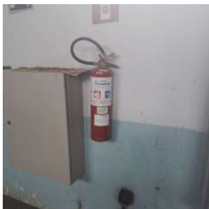
Foto 1 - Extintor de incêndio.
