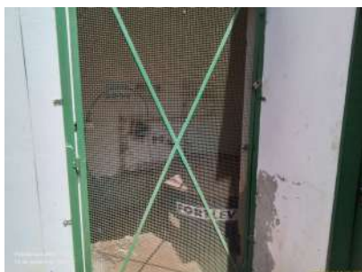
Foto 1 - Tanque de armazenamento e dosagem de Hipoclorito de Sódio.
