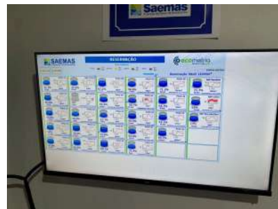
Foto 2 - CCO com monitoramento dos reservatórios.
