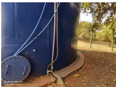
Foto 1 - Detalhe do medidor de nível do reservatório.
