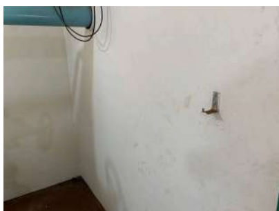
Foto 1 - Ausência de extintor de incêndio.
