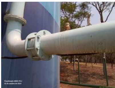
Foto 1 - Vazamento na TAP.
