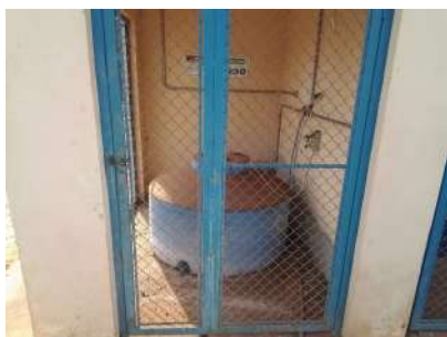
Foto 1 - Tanque de armazenamento e dosagem de Ácido Fluossilícico.
