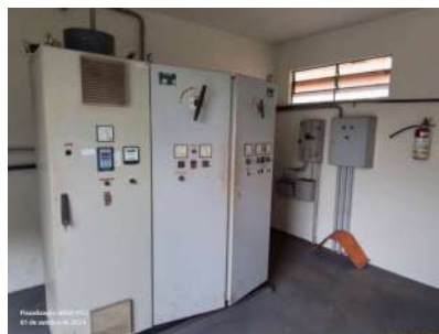
Foto 4 - Painéis elétricos da EEA.
