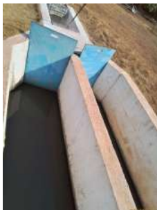
Foto 1 - Comportas travadas e inoperantes no canal desarenador.
