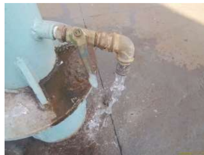
Foto 2 - Torneira de tomada da água bruta em funcionamento.
