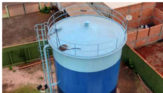
Foto 2 - Tubulação de ventilação.
