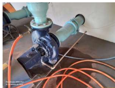
Foto 2 - Tubulação para drenagem da água de lubrificação.
