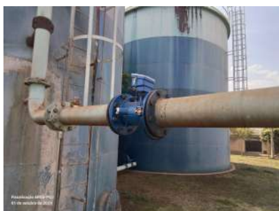
Foto 1 - Macromedidor instalado na tubulação do poço.
