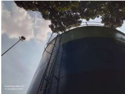
Foto 1 - Tubo extravasor do reservatório.
