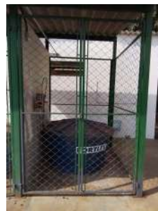
Foto 2 - Tanque de armazenamento e dosagem de Ácido Fluossilícico.
