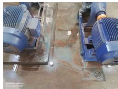
Foto 3 - Ralo do sistema de drenagem entupido, causando acúmulo de água no local.
