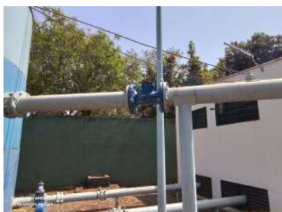
Foto 1 - Macromedidor instalado na tubulação do poço.
