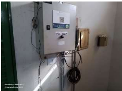
Foto 5 - Painel de automação da EEA.
