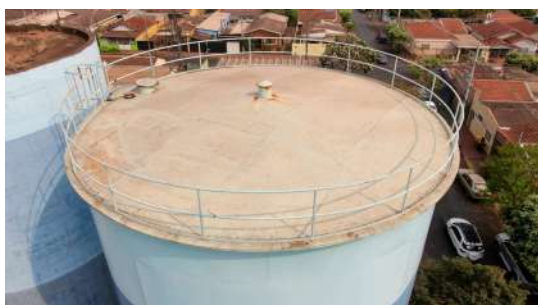
Foto 1 - Tubulação de ventilação do reservatório metálico..
