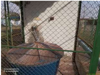
Foto 4 - Tanque de armazenamento e dosagem de Hipoclorito de Sódio.
