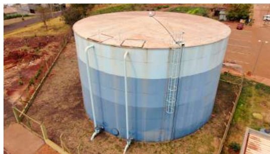
Foto 2 - Guarda-corpo na escada e no topo do reservatório.
