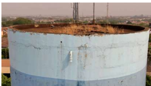
Foto 2 - Extravasador do reservatório de concreto sem tela, conforme item [RES-6.12].
