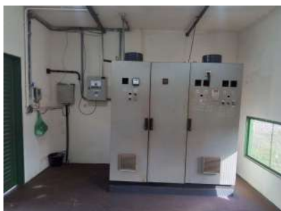
Foto 5 - Painel elétrico da EEA.
