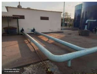
Foto 8 - Vista das tubulações de sucção da EEA.
