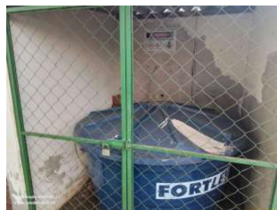
Foto 4 - Tanque de armazenamento e dosagem de Hipoclorito de Sódio.
