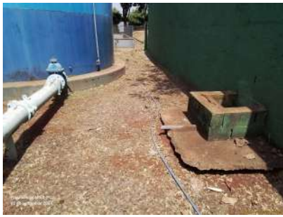
Foto 3 - Mangueira para aplicação de Hipoclorito de Sódio.
