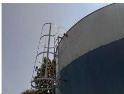
Foto 1 - Ausência de guarda-corpo na parte superior do reservatório próximo à escada.
