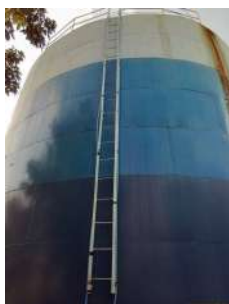
Foto 1 - Ausência de guarda-corpo na escada do reservatório.
