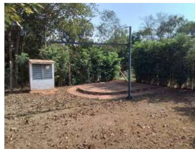
Foto 4 - Vista geral do interior da EEE.
