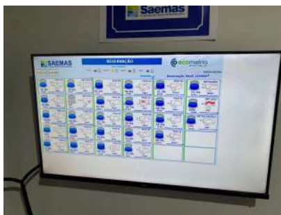
Foto 3 - CCO com monitoramento dos reservatórios.
