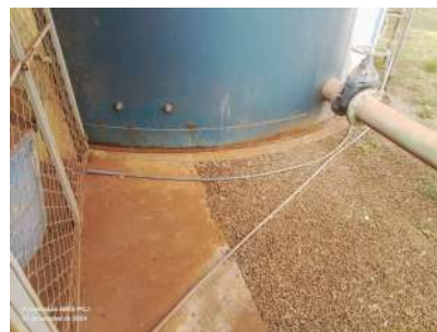
Foto 2 - Mangueiras para aplicação de Hipoclorito de Sódio e Ácido Fluossilícico.
