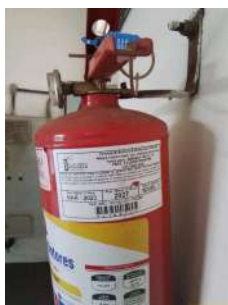
Foto 1 - Manutenção de 2º nível expirada.
