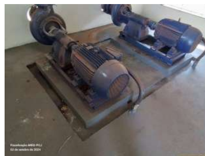
Foto 2 - Sistema de drenagem da água de lubrificação.
