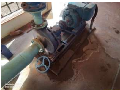
Foto 1 - Água de lubrificação escoando pelo local devido à inexistência de drenagem adequada.
