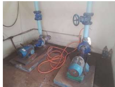
Foto 2 - Conjunto motobombas, uma em funcionamento e a outra como reserva.
