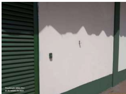
Foto 1 - Suporte sem extintor.
