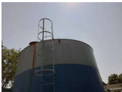
Foto 1 - Ausência de proteção no tubo extravasor.
