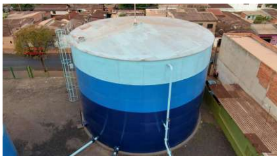
Foto 3 - Ausência de tampa de inspeção.
