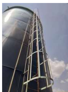
Foto 2 - Más condições de conservação da escada e guarda-corpo do reservatório.
