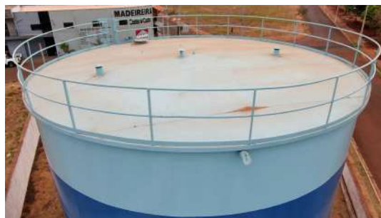
Foto 2 - Tubulação de ventilação no topo e extravasor.
