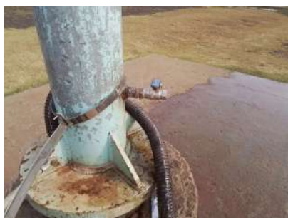
Foto 1 - Torneira de tomada da água bruta.
