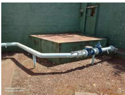
Foto 7 - Recalque da EEA.
