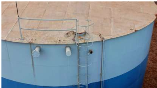
Foto 1 - Tubo extravasor com proteção basculante.
