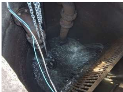
Foto 1 - Poço com 1 bomba instalada.
