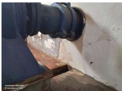
Foto 1 - Vazamento na tubulação da bomba.
