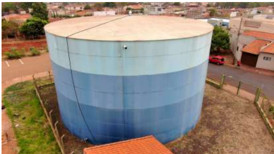
Foto 1 - Extravasor sem tela de proteção.
