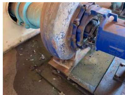
Foto 2 - Detalhe do acúmulo de água de lubrificação.
