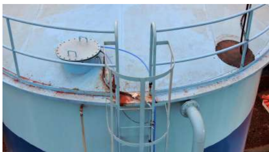
Foto 1 - Tampa desencaixada devido à mangueira de doseagem de produtos.
