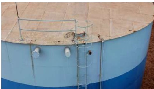
Foto 4 - Ausência de guarda-corpo no perímetro próximo às tampas de inspeção.
