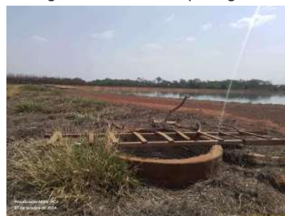
Foto 6 - Caixa de passagem do efluente para a lagoa anaeróbia desprotegida.
