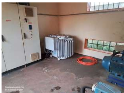
Foto 5 - Transformador da EEA.
