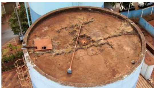
Foto 1 - Tampa do reservatório de concreto com aberturas e sem borda.
