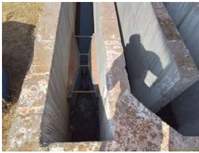
Foto 5 - Calha parshall de saída.
