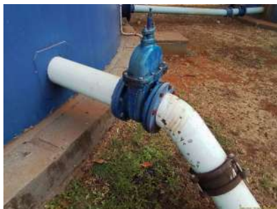
Foto 1 - Vazamento na parte superior da tubulação.
