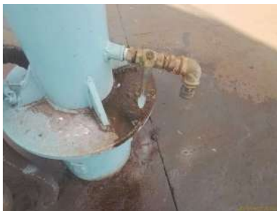
Foto 1 - Torneira de tomada da água bruta.
