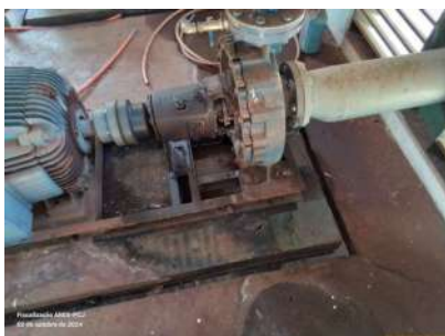
Foto 1 - Detalhe do sistema de drenagem.
