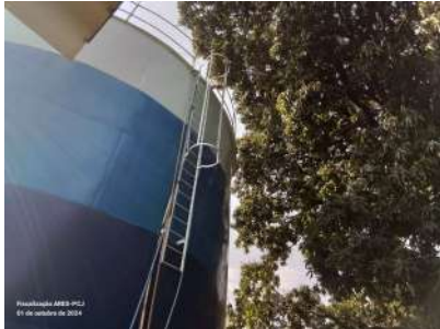
Foto 1 - Ausência de proteção no tubo extravasor.
