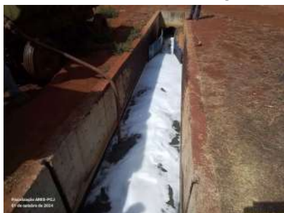
Foto 26 - Canal de saída.
