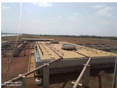
Foto 8 - Vista dos reatores UASB 1 e 2.
