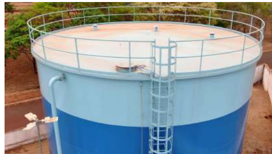
Foto 2 - Tampa desencaixada devido à mangueira de doseagem de produtos.
