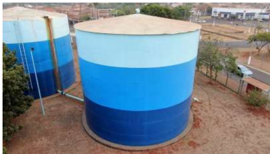
Foto 2 - Tubulação de ventilação no topo do reservatório sem tela.
