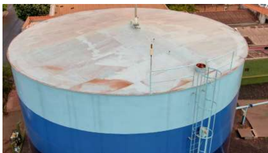
Foto 1 - Guarda-corpo do reservatório.
