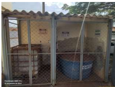
Foto 1 - Casa de química para armazenamento e dosagem de Hipoclorito de Sódio e Ácido Fluossilícico.
