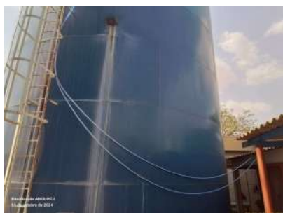
Foto 3 - Mangueiras para aplicação de Ácido Fluossilícico e Hipoclorito de Sódio.
