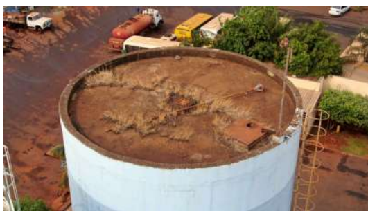
Foto 4 - Ausência de guarda-corpo no topo do reservatório de concreto.
