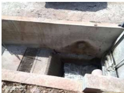
Foto 1 - Sistema de gradeamento.
