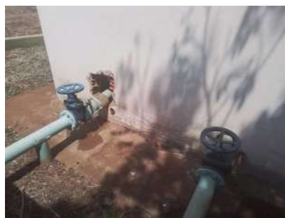
Foto 6 - Vista detalhada das tubulações de secção da EEA.
