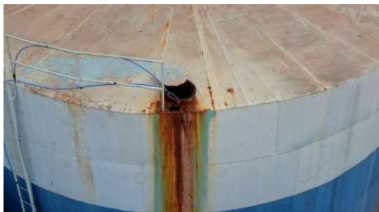
Foto 1 - Tampa de inspeção aberta e corroída.
