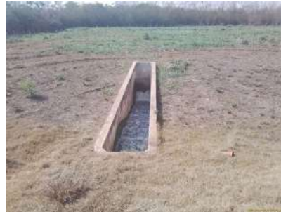
Foto 20 - Saída do efluente tratado com escada hidráulica para reaeração.
