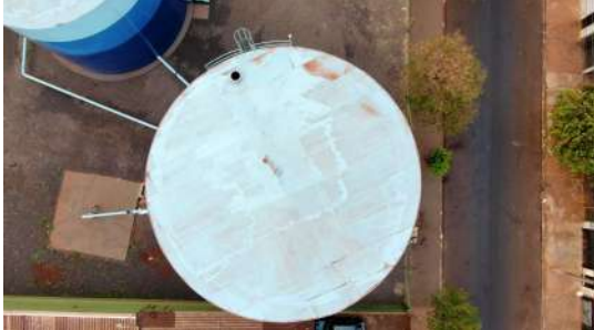
Foto 3 - Captor com ausência de cabo condutor.
