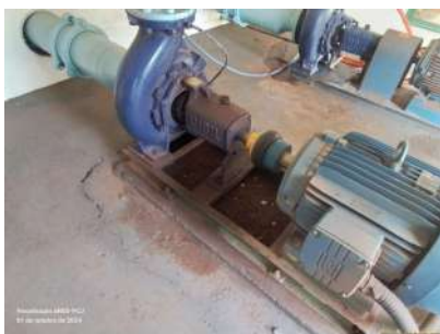
Foto 1 - Área de drenagem da água de lubrificação embaixo da bomba reserva.
