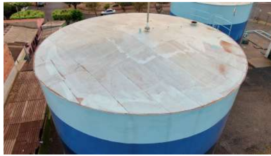
Foto 2 - Ausência de cabo condutor de descarga.
