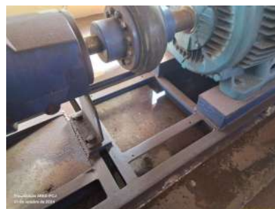
Foto 2 - Detalhe da bomba sem sistema de drenagem.
