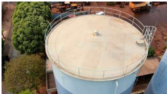
Foto 1 - Tubulação de ventilação do reservatório metálico.
