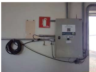
Foto 1 - Ausência de extintor de incêndio.
