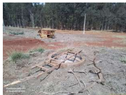
Foto 4 - Caixa de passagem do efluente para a lagoa anaeróbia desprotegida.
