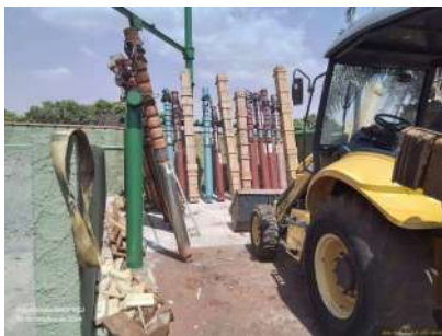
Foto 1 - Bombas reservas da SAEMAS.
