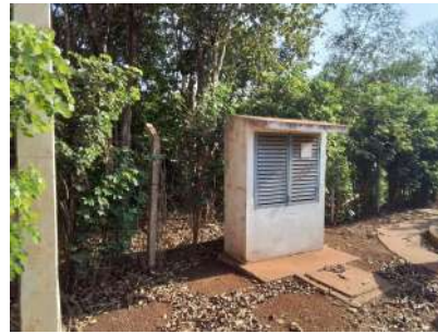
Foto 2 - Painel elétrico da EEE.
