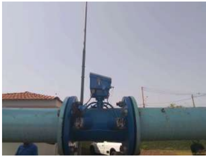
Foto 1 - Macromedidor instalado na tubulação do poço.
