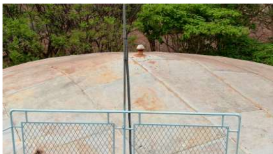
Foto 1 - Tubulação de ventilação no topo.
