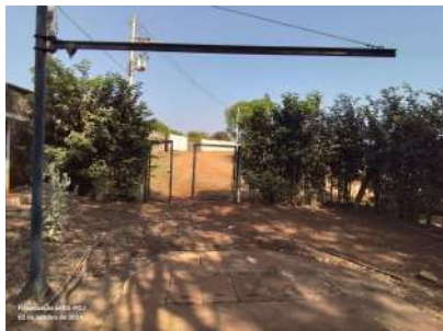
Foto 1 - Acesso à EEEB e estrutura para içamento de bombas.
