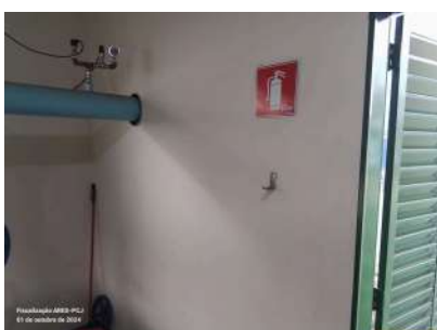
Foto 1 - Ausência de extintor de incêndio.
