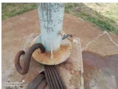
Foto 1 - Torneira de tomada de água bruta.
