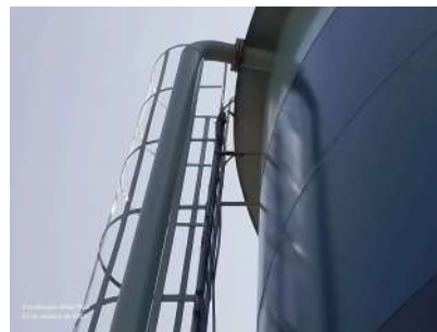
Foto 2 - Escada do reservatório apresenta corrosão.
