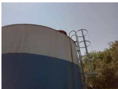
Foto 1 - Oxidação na tampa de inspeção.
