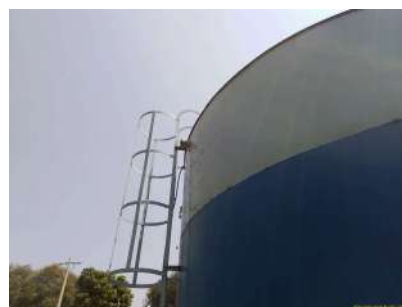
Foto 2 - Tubo extravasor sem tampa de proteção e oxidado.
