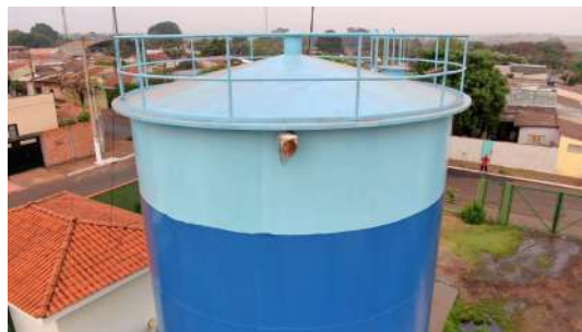
Foto 2 - Tubo extravasor do reservatório.
