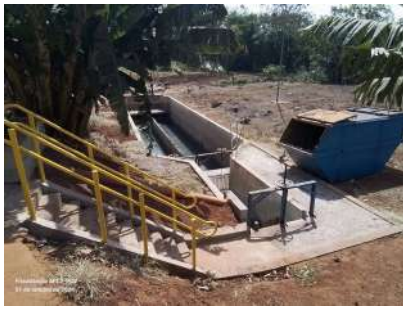
Foto 1 - Vista geral do tratamento preliminar da EEE.
