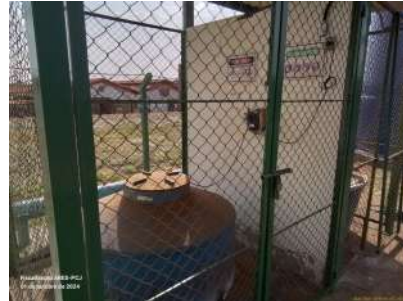
Foto 3 - Tanque de armazenamento e dosagem de Ácido Fluossilícico.
