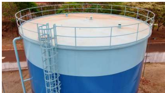
Foto 1 - Tubulação de ventilação.
