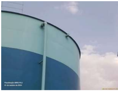
Foto 1 - Tubo extravasor com tampa de proteção.
