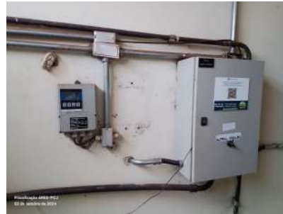
Foto 4 - Pannel de controle da EEA.
