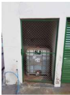
Foto 1 - Tanque de armazenamento e dosagem de Hipoclorito de Sódio.
