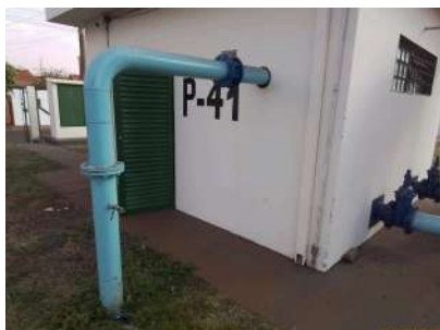
Foto 7 - Vista do recalque da EEA.
