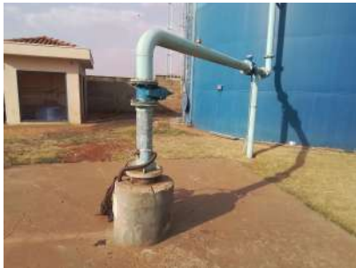
Foto 2 - Vista detalhada do poço de captação.
