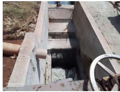
Foto 2 - Sistema de gradeamento.
