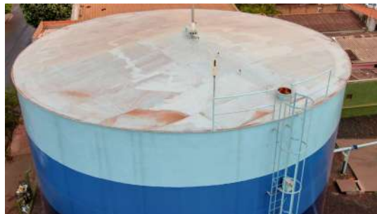
Foto 2 - Tubulação de ventilação.
