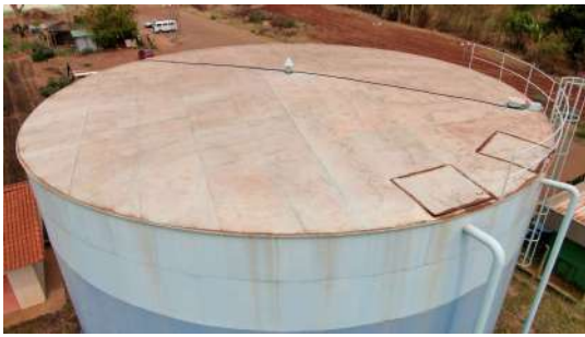
Foto 3 - Tapa de inspeção sem proteção de guarda-copro.
