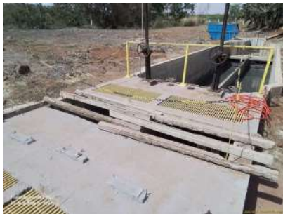
Foto 1 - Buraco no piso sem proteção contra queda.
