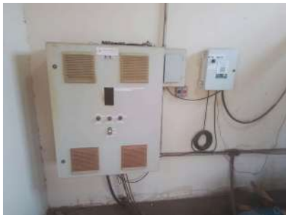
Foto 1 - Painel elétrico da EEA.
