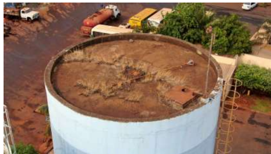
Foto 2 - Ausência de tubulação de ventilação no reservatório de concreto.
