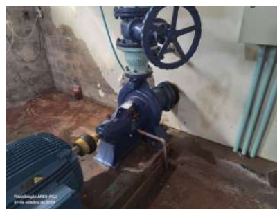
Foto 2 - Vista do local e presença de água no chão oriunda de vazamento.
