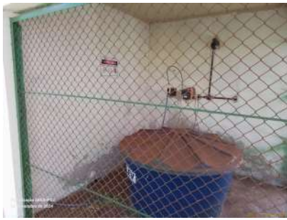
Foto 3 - Tanque de armazenamento e dosagem de Hipoclorito de Sódio.
