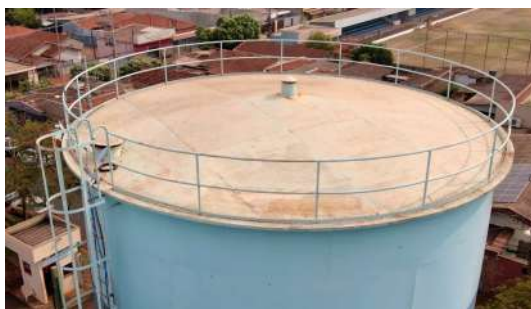
Foto 2 - Recomenda-se adequar a aplicação de produtos e fechar a tampa de inspeção do reservatório metálico.
