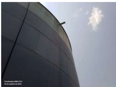
Foto 1 - Tubo extravasor do reservatório.
