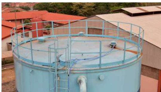
Foto 3 - Tubo extravasor (à direita da escada) com tampa de proteção.
