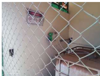
Foto 4 - Tanque de armazenamento e dosagem de Ácido Fluossilícico.
