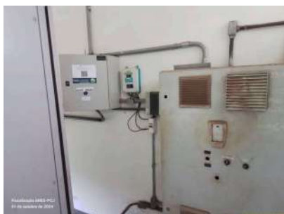
Foto 5 - Painel de controle da EEA.
