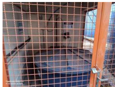
Foto 2 - Tanque de armazenamento de Hipoclorito de Sódio.
