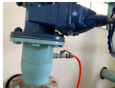
Foto 2 - Válvula de registro com vazamento.
