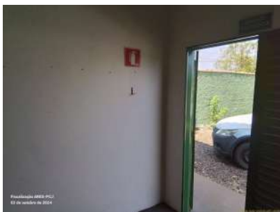
Foto 1 - Ausência de extintor de incêndio.
