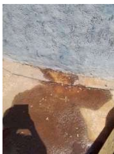
Foto 1 - Vazamento na base do reservatório de concreto.
