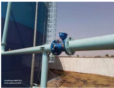
Foto 1 - Macromedidor instalado na tubulação do poço.
