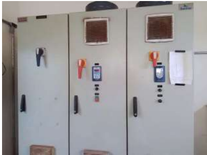
Foto 2 - Vista geral do painel elétrico da EEA.
