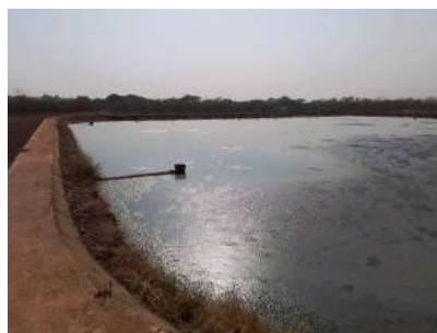
Foto 6 - Detalhe da lagoa anaeróbia 01 com tubulação de saída de esgoto.
