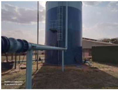
Foto 1 - Mangueiras para aplicação de Hipoclorito de Sódio e Ácido Fluossilícico.
