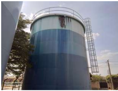
Foto 5 - Oxidação na parte superior da estrutura metálica.
