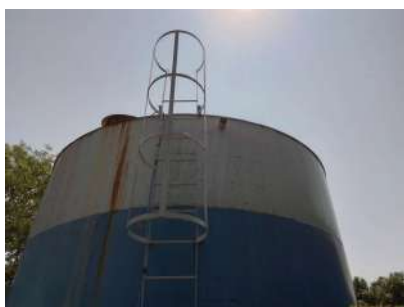
Foto 1 - Tubo extravasor sem tampa de proteção e oxidado.
