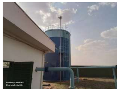
Foto 2 - Guarda-corpos na escada e em todo perímetro do topo do reservatório.
