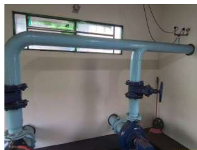
Foto 6 - Vista do recalque da EEA.
