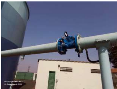
Foto 1 - Macromedidor instalado na tubulação do poço.
