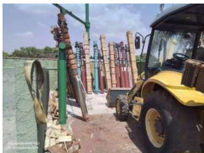
Foto 1 - Bombas reservas da SAEMAS.
