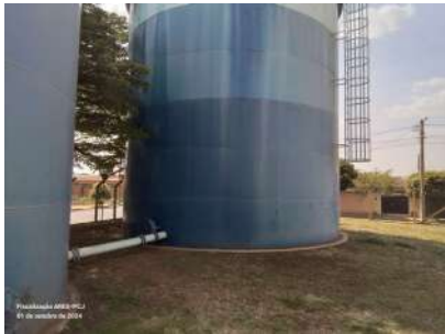
Foto 4 - Tubulação de conexão dos dois reservatórios.
