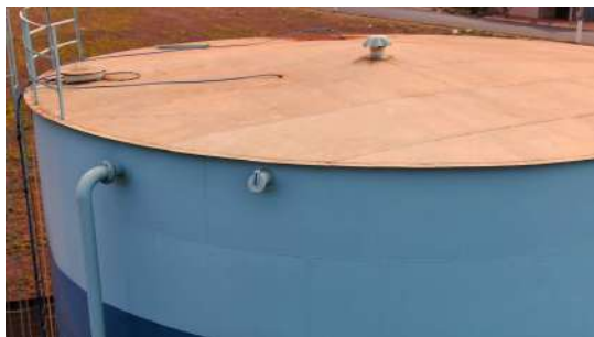
Foto 1 - Tubulação de ventilação.
