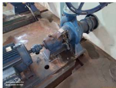
Foto 2 - Sistema de drenagem da água de lubrificação, conduzindo-a para fora da edificação.
