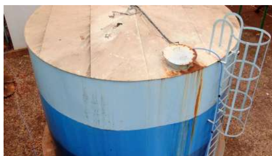
Foto 2 - Ausência de guarda-corpo na parte superior do reservatório próximo à escada.
