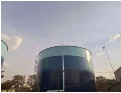
Foto 1 - Captor no topo de um dos reservatórios.
