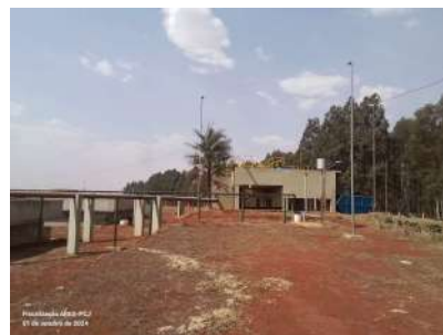
Foto 13 - Vista do tratamento preliminar.
