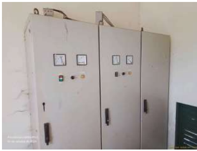
Foto 10 - Paineleletrico do sistema.
