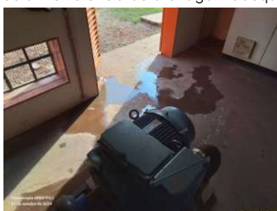
Foto 3 - Água de lubrificação escoando pelo local devido à inexistência de drenagem adequada.
