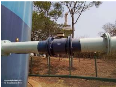
Foto 1 - Macromedidor no cavalete.
