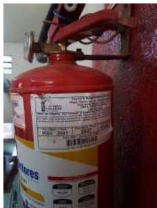
Foto 1 - Manutenção de 2º nível expirada.
