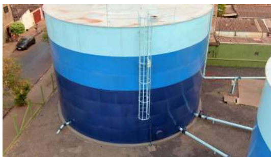
Foto 2 - Guarda-corpo do reservatório.
