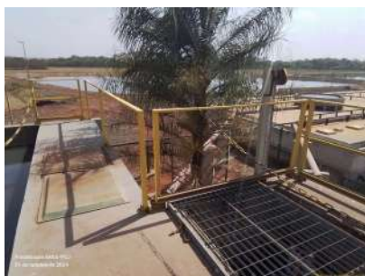
Foto 3 - Guarda-corpo dos desarenadores sem travessa intermediária.
