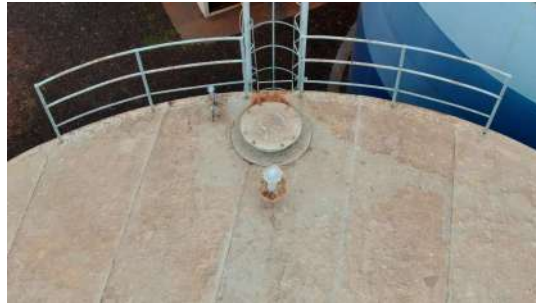
Foto 2 - Tubulação de ventilação no topo.
