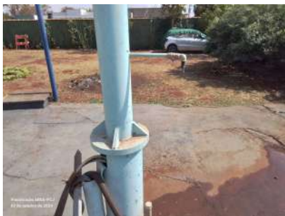
Foto 1 - Torneira para tomada de água bruta.
