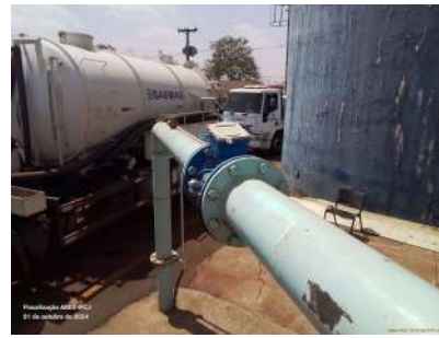
Foto 2 - Macromedidor instalado na tubulação do poço.
