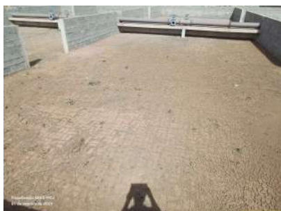
Foto 24 - Fundo do leito de secagem de lodo.
