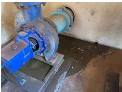
Foto 1 - Ausência de drenagem da água de lubrificação, ocasionando acúmulo no interior da edificação.
