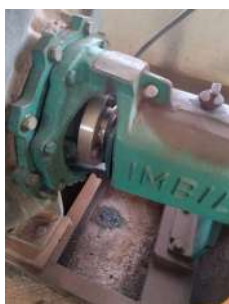
Foto 1 - Área para drenagem da água de lubrificação embaixo da bomba.
