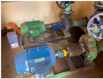
Foto 1 - Conjunto motobomba, uma em operação e outra como reserva.
