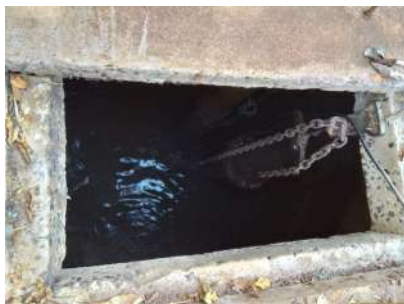
Foto 1 - Motobomba em funcionamento; não possui motobomba reserva.
