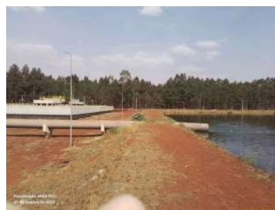
Foto 17 - Terceira entrada lateral da lagoa anaeróbia.
