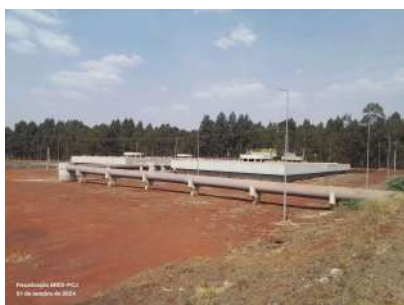
Foto 16 - Vista da tubulação que liga os UASBs à lagoa anaeróbia.
