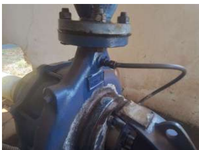
Foto 1 - Vazamento em uma junção da bomba.
