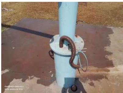
Foto 1 - Medição de nível realizada por meio de sonda.
