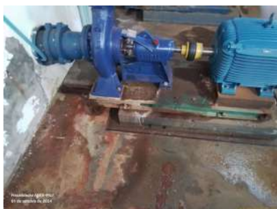
Foto 1 - Sistema de drenagem da água de lubrificação, conduzindo-a para fora da edificação.
