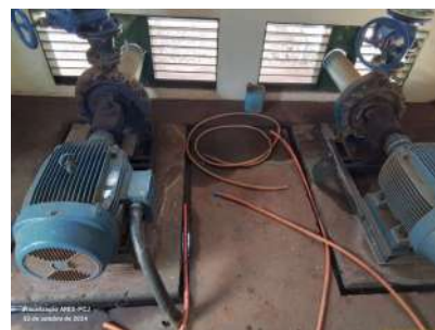
Foto 2 - Sistema de drenagem da água de lubrificação.
