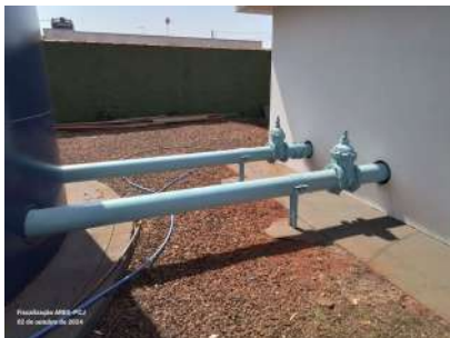
Foto 2 - Detalhe das tubulações de sucção da EEA.
