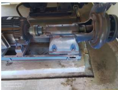
Foto 1 - Detalhe do sistema de drenagem da água de lubrificação.
