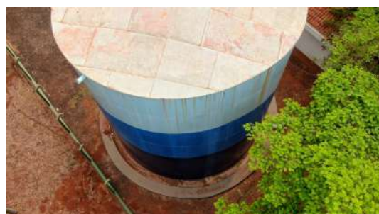
Foto 2 - Tubo extravasor do reservatório.
