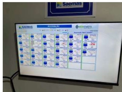
Foto 2 - CCO com monitoramento dos reservatórios.
