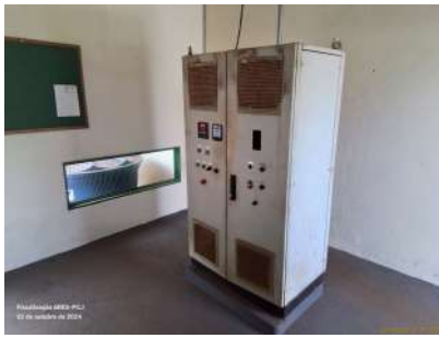
Foto 7 - Painel de comando da EEA.
