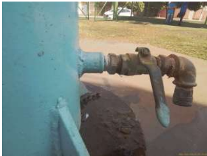
Foto 1 - Pequeno vazamento na junção da torneira de tomada de água bruta com a tubulação do poço.
