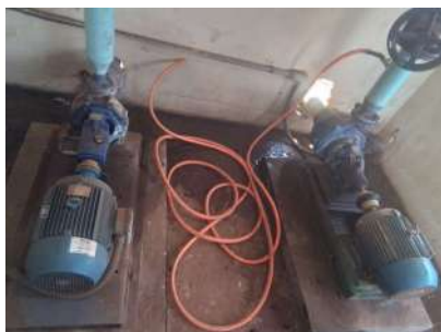
Foto 3 - Conjunto motobomba da EEA.
