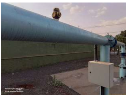
Foto 1 - Presença de vazamento na TAP.
