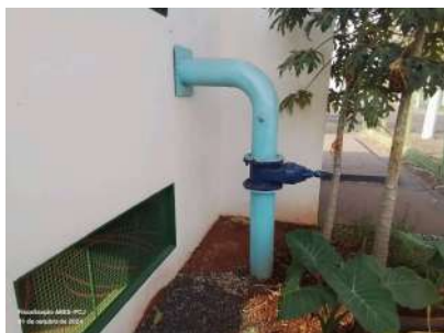
Foto 7 - Vista do recalque da EEA.
