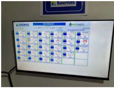
Foto 3 - CCO com monitoramento dos reservatórios.
