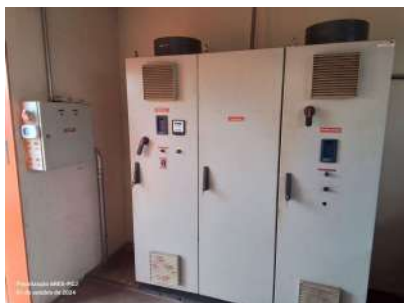
Foto 3 - Painel elétrico da EEA.
