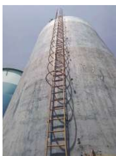
Foto 1 - Ausência de guarda-corpo no topo do reservatório.
