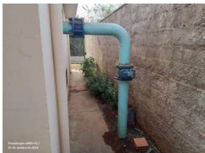
Foto 7 - Recalque da EEA.
