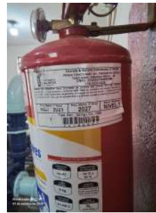
Foto 2 - Manutenção de 2º nível expirada.
