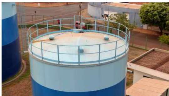
Foto 5 - Tubulações de ventilação.
