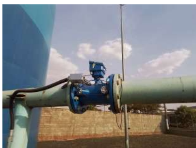
Foto 1 - Macromedidor instalado na tubulação do poço.
