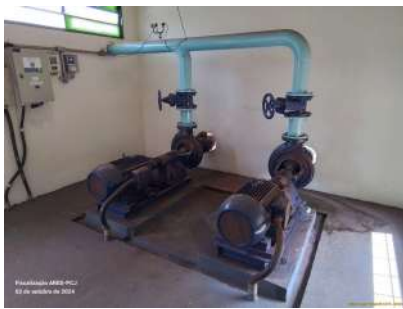
Foto 1 - Conjunto motobombas, uma em funcionamento e a outra como reserva.
