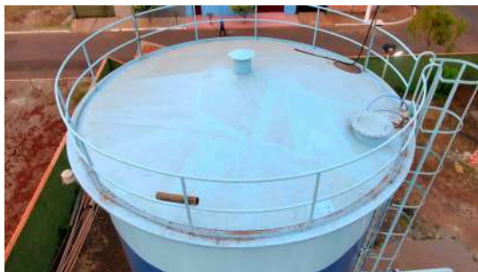
Foto 2 - Tubulação de ventilação.
