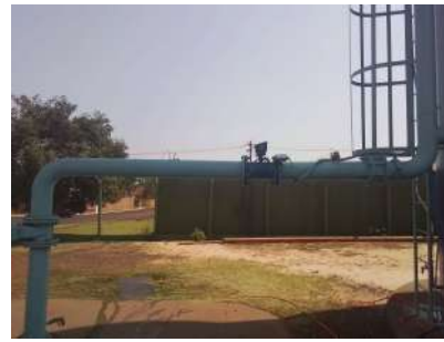
Foto 4 - Detalhe da tubulação da captação subterrânea.
