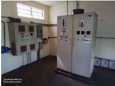
Foto 3 - Painéis elétrico e de controle da EEA.
