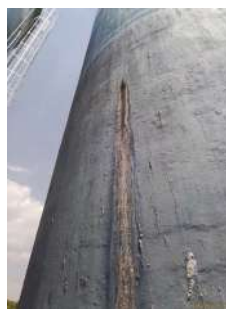
Foto 2 - Vazamento na estrutura de concreto do reservatório.
