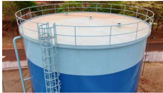
Foto 2 - Guarda-corpo do reservatório.
