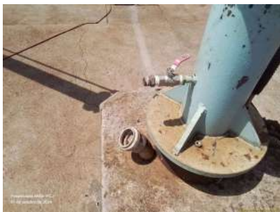
Foto 1 - Torneira para tomada de água bruta.
