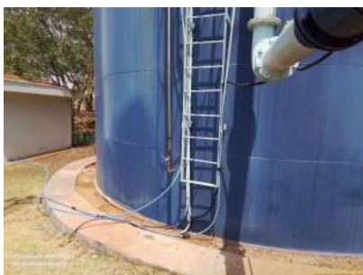
Foto 1 - Mangueiras de aplicação de Ácido Fluossilícico e Hipoclorito de Sódio no reservatório.
