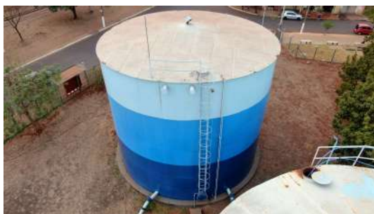
Foto 2 - Ausência de guarda-corpo no perímetro próximo às tampas de inspeção.
