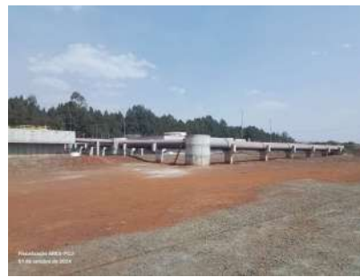
Foto 2 - Vista dos reatores UASB 3 e 4.
