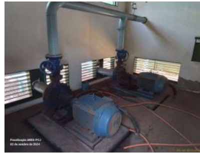
Foto 2 - Vista geral do interior da edificação da EEA com o conjunto motobomba.
