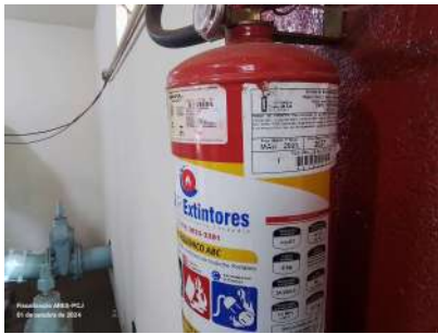
Foto 1 - Manutenção de 2º nível expirada.
