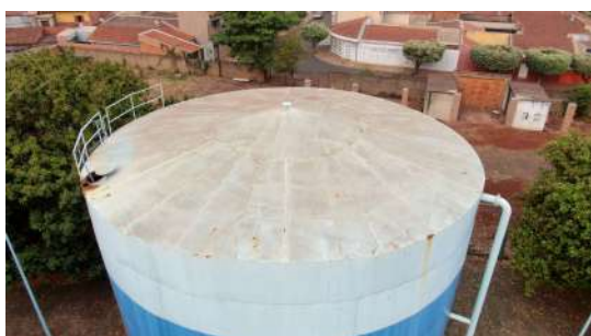
Foto 3 - Tubulação de ventilação no topo do reservatório sem tela.
