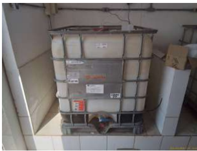
Foto 17 - Sistema de dosagem de hipoclorito para desinfecção sem produto.
