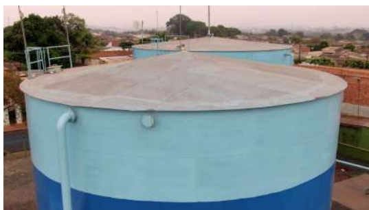
Foto 2 - Tubo extravasor do reservatório.
