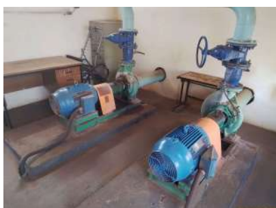
Foto 1 - Conjunto motobomba, uma em funcionamento e uma como reserva.
