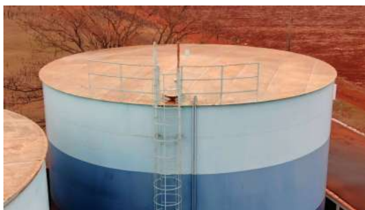
Foto 2 - Guarda-corpo do reservatório.
