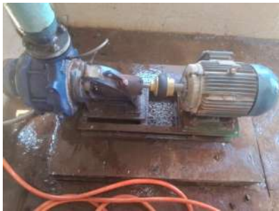
Foto 1 - Ausência de sistema de drenagem de água, causando acúmulo no local.
