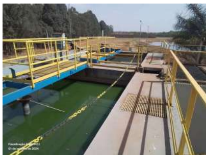
Foto 1 - Tanques desarenadores sem guarda-corpo.
