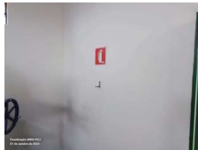
Foto 6 - Ausência de extintor de incêndio no interior da edificação.
