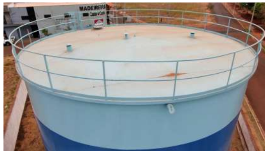
Foto 3 - Guarda-corpo do reservatório.
