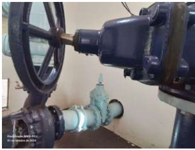
Foto 1 - Detalhe do vazamento na válvula do recalque.
