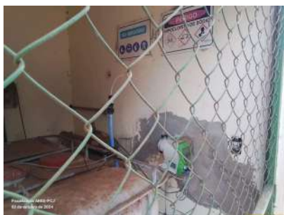
Foto 3 - Tanque de armazenamento e dosagem de Hipoclorito de Sódio.
