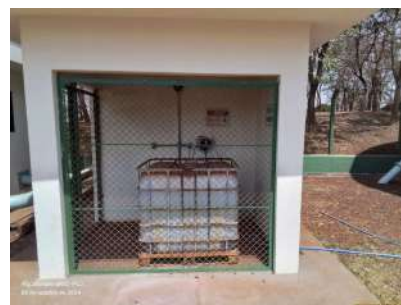
Foto 2 - Tanque de armazenamento e dosagem de Ácido Fluossilícico.
