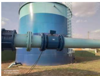
Foto 1 - Macromedidor instalado na tubulação do poço.
