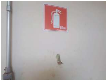
Foto 1 - Ausência de extintor.
