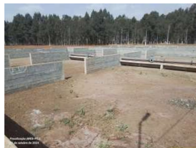
Foto 23 - Leito de secagem de lodo.
