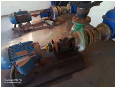
Foto 1 - Sistema de drenagem de água de lubrificação.
