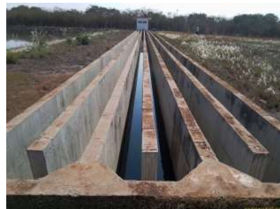
Foto 14 - Tanque de contato.
