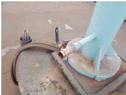
Foto 1 - Torneira de tomada de água bruta.
