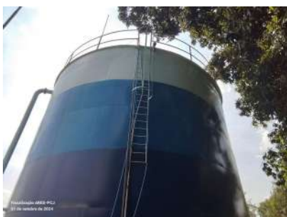
Foto 1 - Guarda-corpo inadequado na escada.
