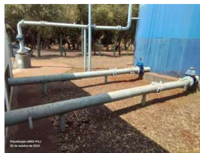
Foto 6 - Vista geral das tubulações de sucção da EEA (primeiro plano).
