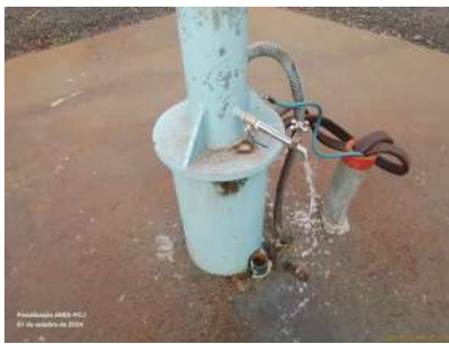
Foto 1 - Torneira para tomada de água bruta em funcionamento.
