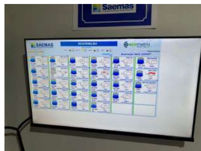
Foto 2 - CCO com monitoramento dos reservatórios.
