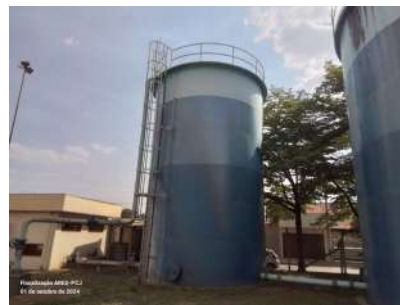
Foto 2 - Guarda-corpos na escada e em todo o perímetro do topo do reservatório.
