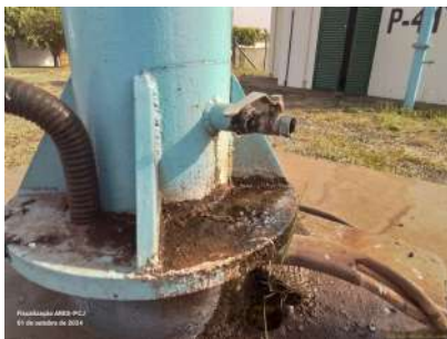
Foto 1 - Vazamento na torneira de água bruta.
