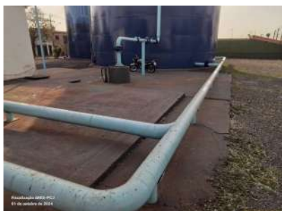
Foto 9 - Vista das tubulações de sucção da EEA.
