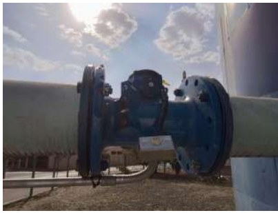
Foto 1 - Macromedidor instalado na tubulação do poço.
