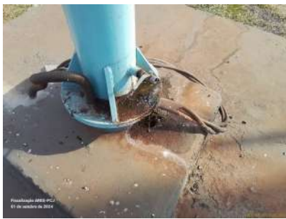
Foto 1 - Torneira para tomada de água bruta.
