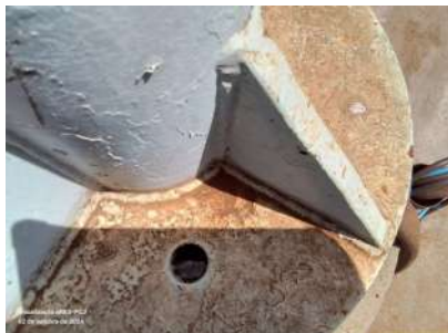
Foto 1 - Apesar da ausência do tubo para medição de nível, ela é realizada por meio de sonda.
