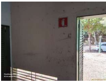
Foto 1 - Ausência de extintor de incêndio.
