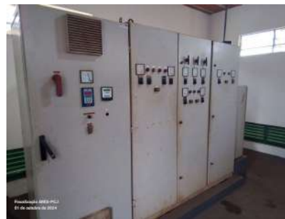
Foto 4 - Painel elétrico da EEA.
