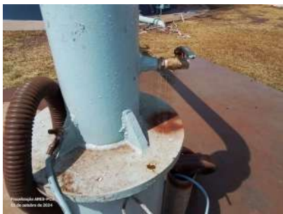
Foto 1 - Torneira para tomada de água bruta.
