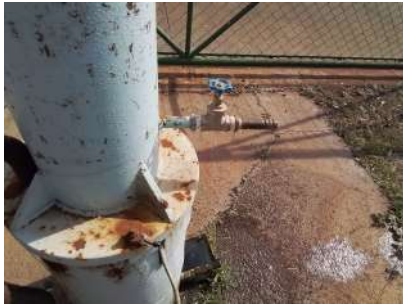
Foto 1 - Torneira para tomada de água bruta.
