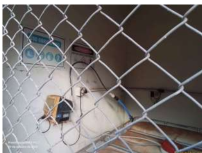
Foto 3 - Equipamento para dosagem de Hipoclorito de Sódio.
