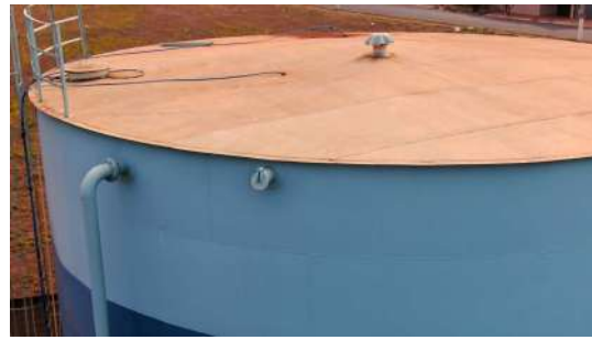
Foto 2 - Extravasor e tubulação de ventilação protegidos.
