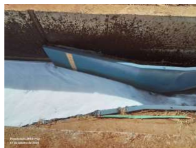
Foto 25 - Calha Parshall de saída.
