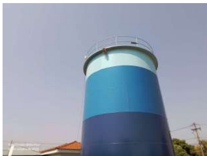
Foto 1 - Tubo extravasor do reservatório.
