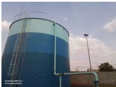
Foto 1 - Tubo extravasor do reservatório.
