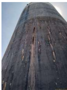
Foto 3 - Evidências de vazamento na estrutura de concreto do reservatório.
