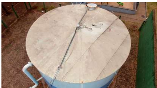
Foto 3 - Tubulação de ventilação.
