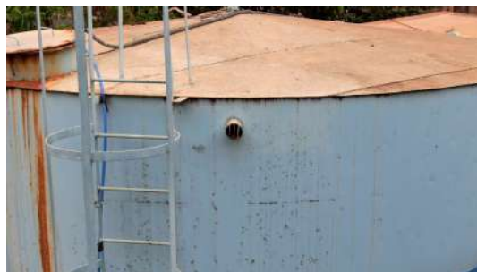
Foto 2 - Ausência de proteção no tubo extravasor.
