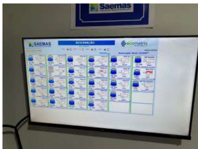
Foto 1 - CCO com monitoramento dos reservatórios.
