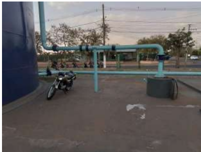
Foto 1 - Tubulação do poço de captação.
