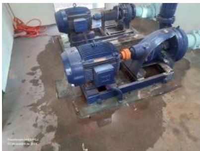
Foto 1 - Ralo do sistema de drenagem entupido, causando acúmulo de água no local.
