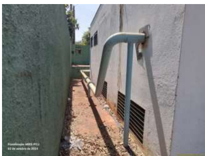
Foto 5 - Recalque da EEA.
