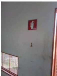
Foto 1 - Ausência de extintor de incêndio.
