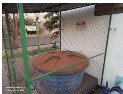
Foto 4 - Tanque de armazenamento e dosagem de Hipoclorito de Sódio e Ácido Fluossilícico.
