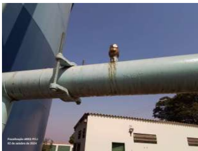
Foto 1 - Vazamento na TAP.
