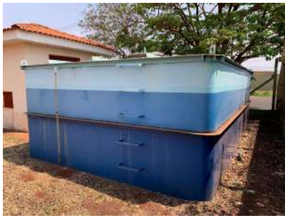
Foto 1 - Parte superior sem guarda-corpo.
