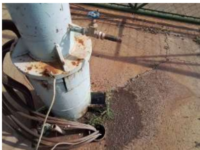
Foto 1 - Vazamento na torneira de tomada de água bruta.
