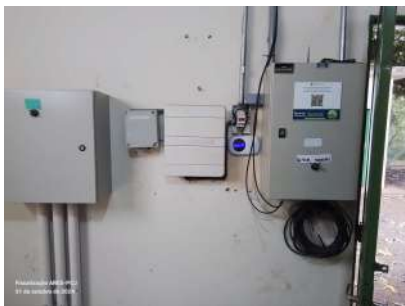
Foto 4 - Pannel de automação da EEA.
