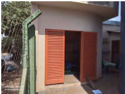
Foto 1 - EEA localiza-se no interior de edificação em local cercado com alambrado.
