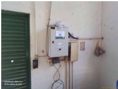
Foto 3 - Painel elétrico da EEA.
