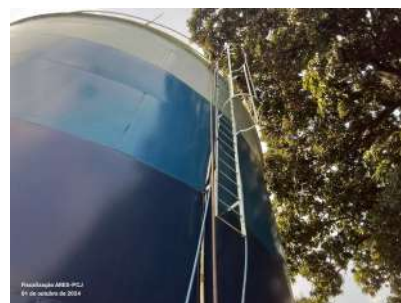
Foto 2 - Medidor de nível do reservatório.
