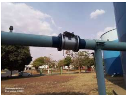
Foto 1 - Macromedidor instalado na tubulação do poço.
