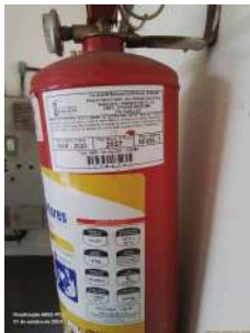
Foto 1 - Manutenção de 2º nível expirada.
