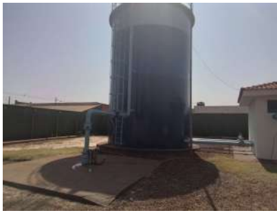
Foto 3 - Vista geral do poço da captação subterrânea.
