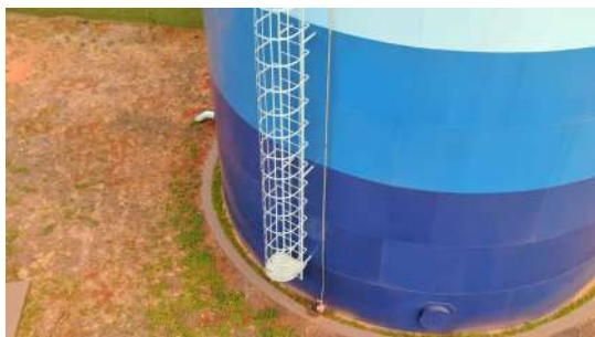
Foto 3 - Tubo de medição de nível.
