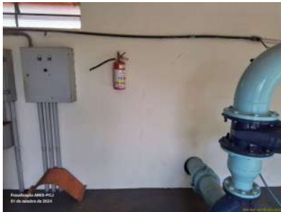
Foto 1 - Extintor de incêndio do local.
