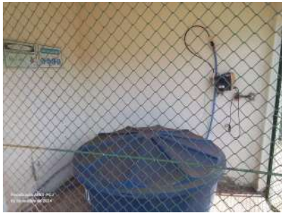
Foto 2 - Tanque de armazenamento e dosagem de Hipoclorito de Sódio.
