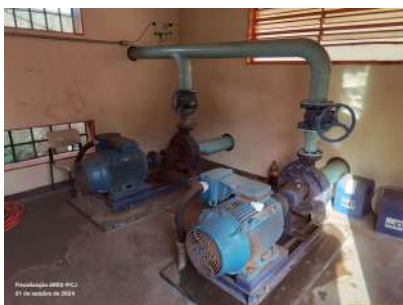
Foto 1 - Conjunto motobombas, uma em funcionamento e a outra como reserva.
