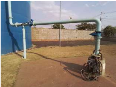
Foto 3 - Cavalete do poço de captação.
