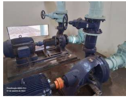
Foto 2 - Vazamento na válvula do recalque.
