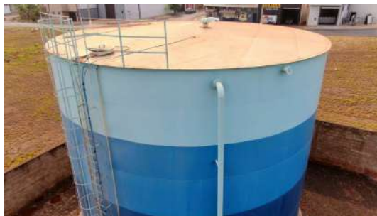
Foto 2 - Tubo extravasor do reservatório.
