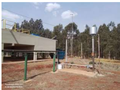
Foto 12 - Tratamento dos gases em instalação.
