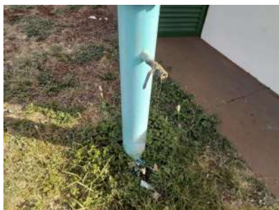
Foto 1 - Vazamento em torneira do recalque da EEA.
