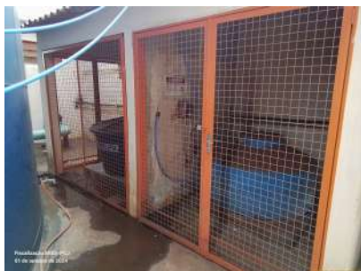
Foto 1 - Tanque de armazenamento de Ácido Fluossilícico.
