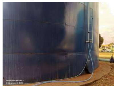
Foto 2 - Mangueiras para aplicação de Hipoclorito de Sódio e Ácido Fluossilícico.
