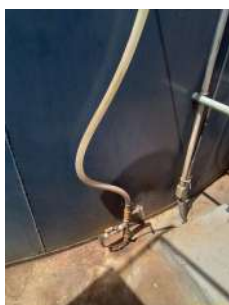
Foto 1 - Mangueira de medição de nível em desuso.
