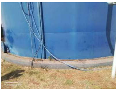
Foto 1 - Mangueiras de aplicação de Ácido Fluossilícico e Hipoclorito de Sódio no reservatório.
