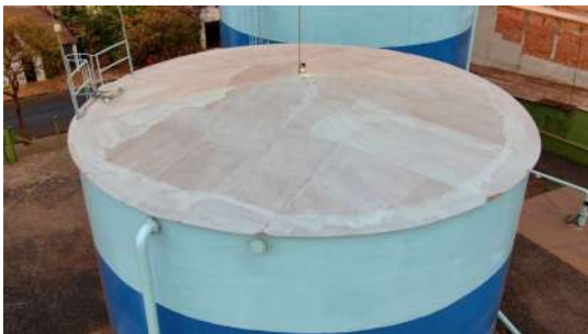
Foto 1 - Tubulação de ventilação sem tela.
