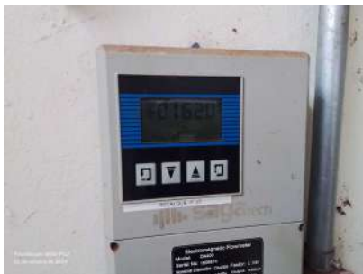
Foto 5 - Detalhe do painel de controle da EEA.
