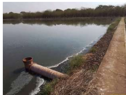
Foto 16 - Detalhe da lagoa facultativa 2 com tubulação de saída de esgoto.
