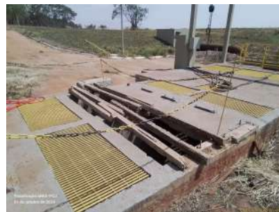
Foto 5 - Ausência de gradil de piso na entrada do poço de sucção.
