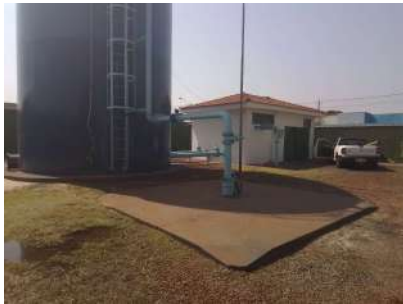
Foto 2 - Vista geral do poço da captação subterrânea.
