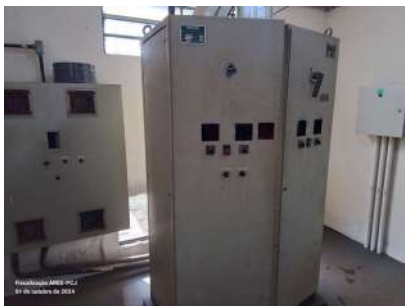
Foto 3 - Painéis elétricos da EEA.
