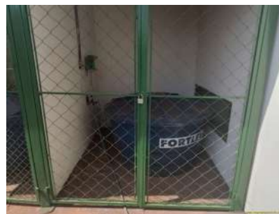
Foto 2 - Tanque de armazenamento e dosagem de Hipoclorito de Sódio.
