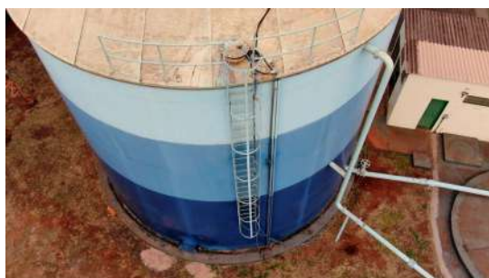
Foto 4 - Guarda-corpo do reservatório.
