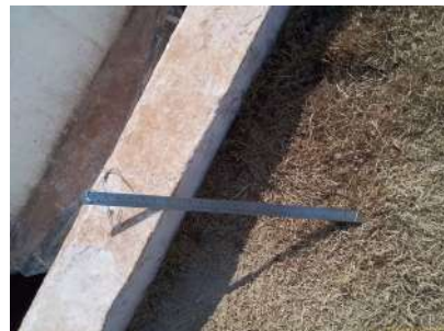
Foto 2 - Régua da calha parshall de entrada.
