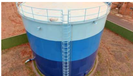
Foto 4 - Tubo extravasor (à direita da escada) com tampa de proteção.
