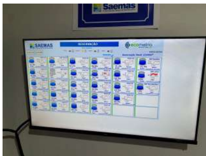
Foto 1 - CCO com monitoramento dos reservatórios.
