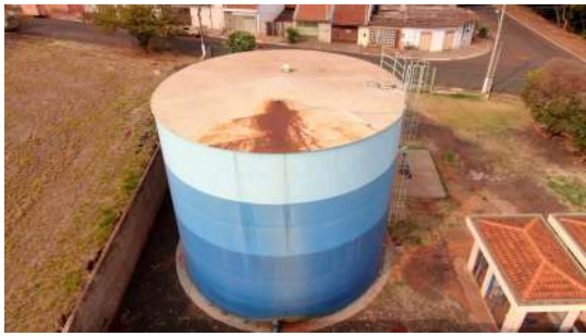
Foto 2 - Oxidação da estrutura metálica.
