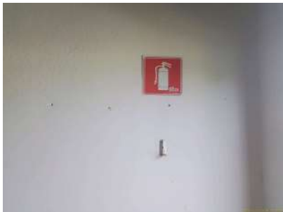
Foto 1 - Ausência de extintor de incêndio.
