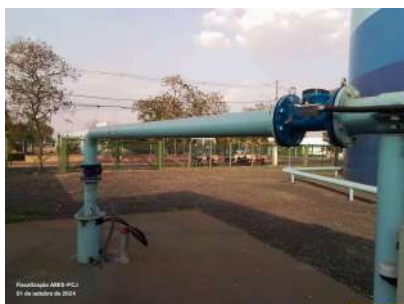
Foto 1 - Macromedidor instalado na tubulação do poço.
