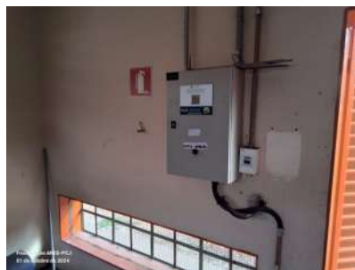
Foto 4 - Painel de controle da EEA.
