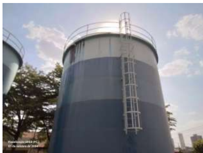
Foto 1 - Guarda-corpos na escada e em todo o perímetro do topo do reservatório.
