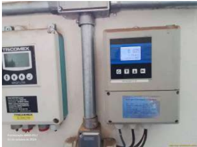
Foto 6 - Detalhe do painel de comando da EEA.
