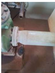
Foto 1 - Vazamento na terminação de tubulação.
