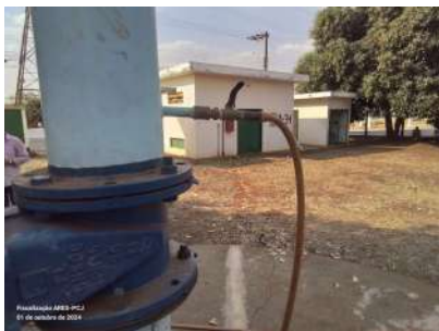
Foto 1 - Torneira de tomada de água bruta.
