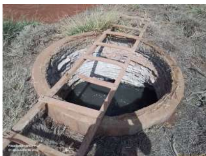
Foto 5 - Caixa de passagem do efluente para a lagoa anaeróbia desprotegida.
