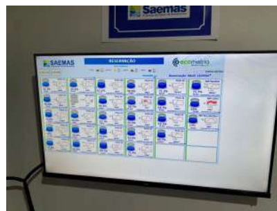
Foto 2 - CCO com monitoramento dos reservatórios.
