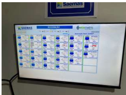
Foto 1 - CCO com monitoramento dos reservatórios.
