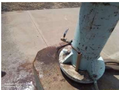
Foto 1 - Torneira para tomada de água bruta.
