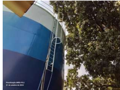
Foto 2 - Tubo extravasor do reservatório.
