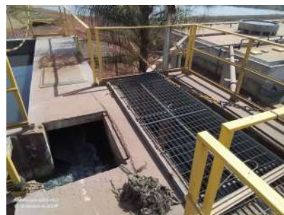
Foto 2 - Área de circulação nos desarenadores sem gradil contra queda.
