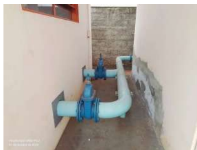
Foto 6 - Tubulação de sucção da EEA.
