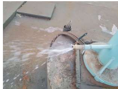
Foto 2 - Torneira de tomada de água bruta em funcionamento.
