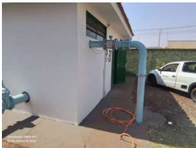
Foto 3 - Recalque da EEA.
