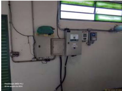
Foto 5 - Painéis elétricos e de comando da EEA.
