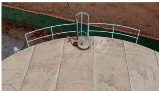
Foto 3 - Guarda-corpo do reservatório.
