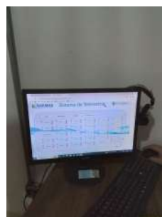
Foto 2 - Sistema de telemetria localizado no Centro de Operações.
