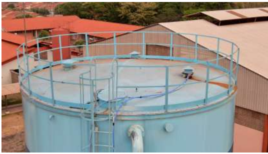
Foto 1 - Tubulação de ventilação com corrosão na base.
