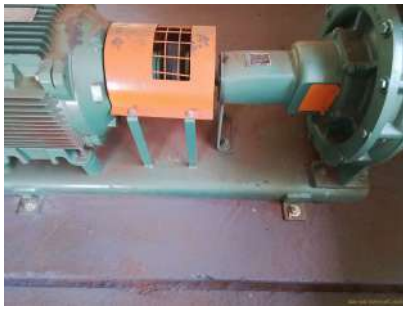
Foto 1 - Sistema de drenagem para a água de lubrificação ao redor da bomba.
