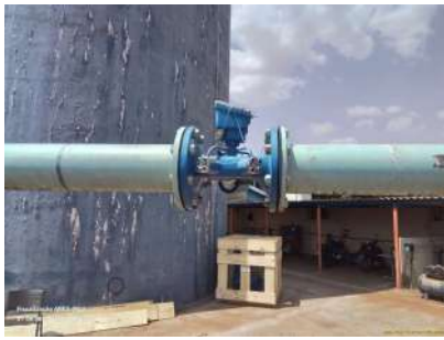
Foto 1 - Macromedidor instalado na tubulação do poço.
