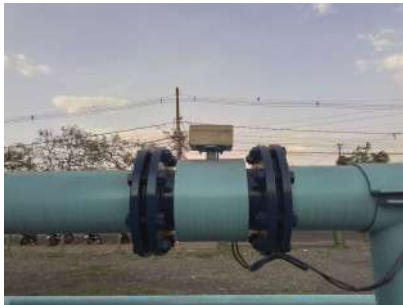
Foto 1 - Macromedidor instalado na tubulação do poço.
