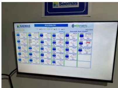
Foto 1 - CCO com monitoramento dos reservatórios.
