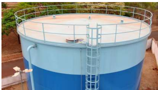
Foto 1 - Tubulação de ventilação no topo.
