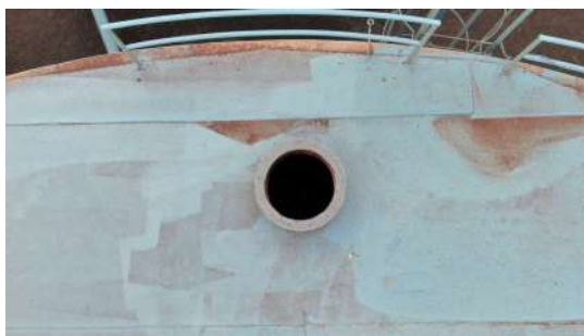
Foto 2 - Ausência de tampa de inspeção.
