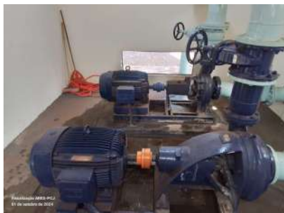
Foto 1 - Conjunto motobomba, uma em funcionamento e outra como reserva.
