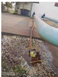
Foto 3 - Saída da tubulação de drenagem da água de lubrificação em área externa.
