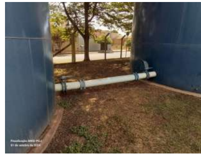
Foto 6 - Tubulação de conexão dos dois reservatórios.
