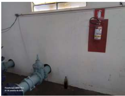
Foto 1 - Extintor de incêndio no interior da edificação.
