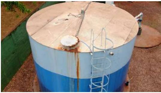
Foto 1 - Tubulação de ventilação no centro.
