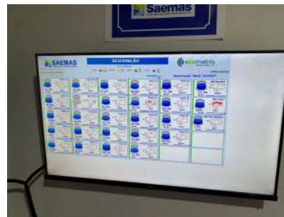
Foto 2 - CCO com monitoramento dos reservatórios.
