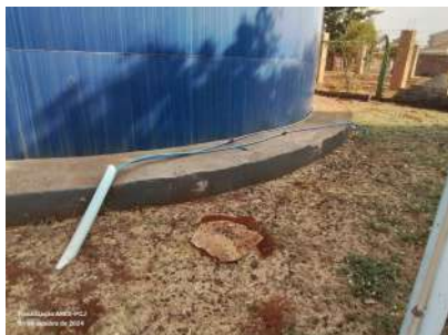
Foto 1 - Mangueiras para aplicação de Hipoclorito de Sódio e Ácido Fluossilícico.
