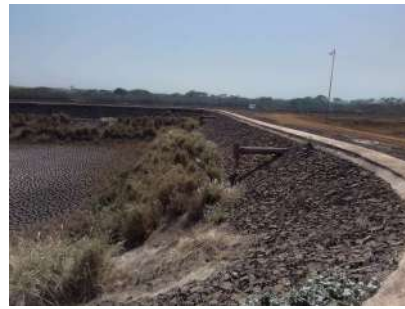
Foto 9 - Detalhe da lagoa anaeróbia 02 desativada com a tubulação de saída de esgoto.
