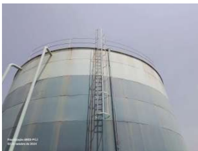
Foto 1 - Guarda-corpo na escada e no topo do reservatório.
