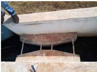
Foto 1 - Calha parshall de entrada.
