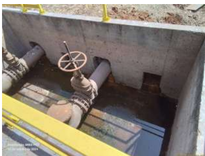
Foto 8 - Válvulas da tubulação de recalque.
