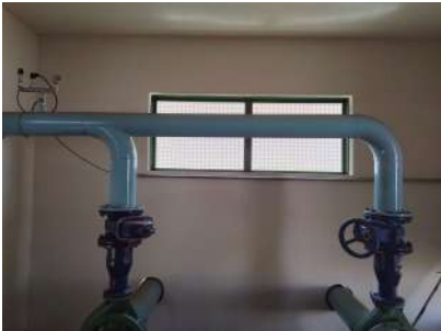
Foto 3 - Tubulação do sistema de recalque da EEA.
