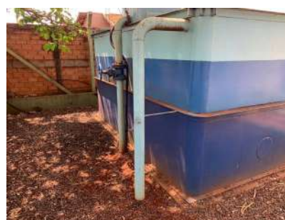
Foto 2 - tubulações do reservatório.
