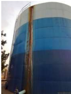
Foto 4 - Vista detalhada do reservatório apresentando oxidação.
