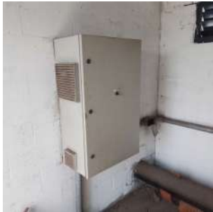
Foto 3 - Painel elétrico da Elevatória de água tratada do Jardim Paraty Apoiado em Cordeirópolis
