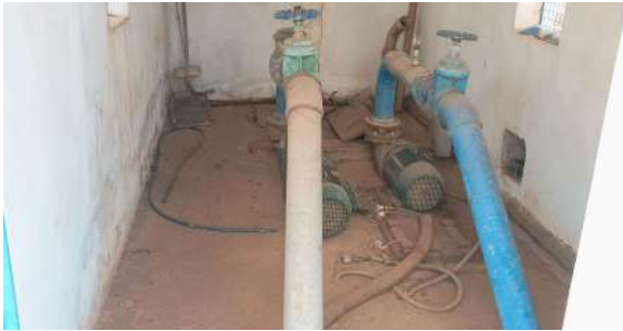
Foto 3 - Materiais estranhos a operação no interno da Elevatória de água tratada do Jardim Módulo em Cordeirópolis
