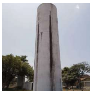
Foto 5 - Vazamentos na estrutura do Reservatório elevado do Jardim Módolo em Cordeirópolis
