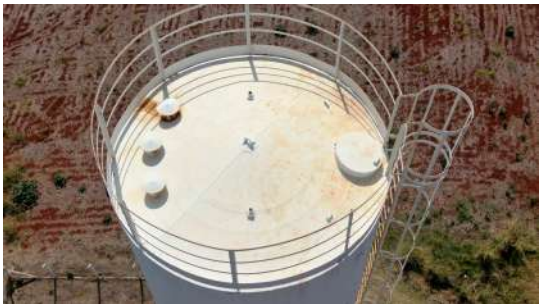
Foto 1 - Tubulações de ventilação do Reservatório elevado Jardim São Luiz em Cordeirópolis
