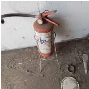
Foto 1 - Extintor de incêndio da Elevatória de água tratada do Jardim Paraty Apoiado em Cordeirópolis
