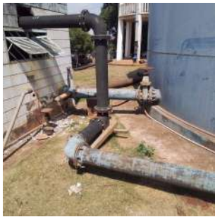
Foto 3 - Tubulações de entrada e de saída Reservatório Apoiado Centro de distribuição de água em Cordeirópolis do
