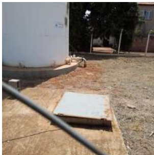
Foto 1 - Manômetro do Reservatório Elevado Jardim Eldorado em Cordeirópolis
