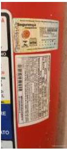
Foto 1 - Extintor de incêndio com a validade expirada da Elevatória de água tratada do Jardim Módolo em Cordeirópolis
