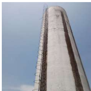
Foto 3 - Vazamentos na estrutura do Reservatório elevado do Jardim Módolo em Cordeirópolis
