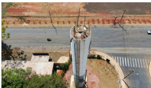
Foto 2 - Para-raios do Reservatório elevado Jardim Cordeiro em Cordeirópolis
