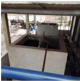
Foto 1 - Aplicação de Flúor da ETA de Cordeirópolis
