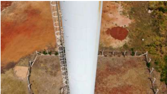
Foto 2 - Guarda-corpo do Reservatório elevado Jardim São Luiz em Cordeirópolis
