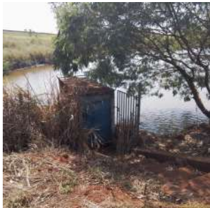
Foto 1 - Ausência de escadas e guarda-corpos para entrar na Captação Santa Marina em Cordeirópolis
