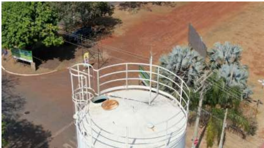
Foto 1 - Tubulação de ventilação do Reservatório elevado Jardim Lise em Cordeirópolis
