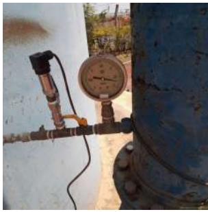
Foto 1 - Manômetro do Reservatório elevado Jardim Cordeiro em Cordeirópolis
