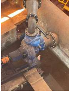
Foto 13 - Vazamento na bomba da ETA de Cordeirópolis
