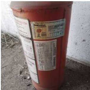
Foto 2 - Extintor de incêndio com a validade expirada da Elevatória de água tratada do Jardim Paraty Apoiado em Cordeirópolis
