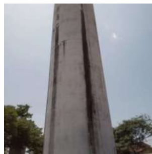
Foto 4 - Vazamentos na estrutura do Reservatório elevado do Jardim Módolo em Cordeirópolis
