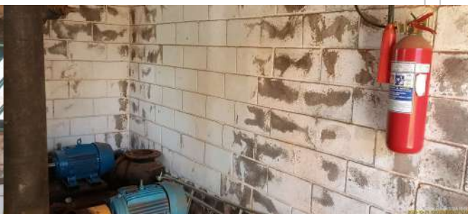
Foto 6 - Extintor de incêndio da Elevatória de água tratada do Centro de distribuição de água em Cordeirópolis
