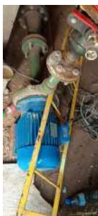
Foto 7 - Bomba da Elevatória de água tratada do Jardim Paraty Elevado em Cordeirópolis
