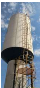
Foto 1 - Para-raios do Reservatório elevado da ETA em Cordeirópolis
