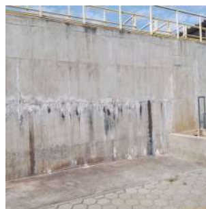
Foto 6 - Vazamento na estrutura dos decantadores e filtros da ETA de Cordeirópolis
