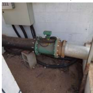
Foto 5 - Tubulação de água da Captação Barro Preto em Cordeirópolis
