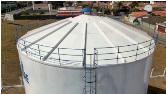
Foto 1 - Tubulação de ventilação do Reservatório Apoiado Jardim Paraty em Cordeirópolis
