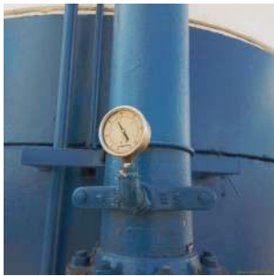
Foto 1 - Manômetro do Reservatório Elevado Jardim Paraty em Cordeirópolis
