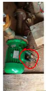
Foto 6 - Bomba extra não ligada na rede elétrica da Elevatória de água tratada do Jardim Paraty Elevado em Cordeirópolis
