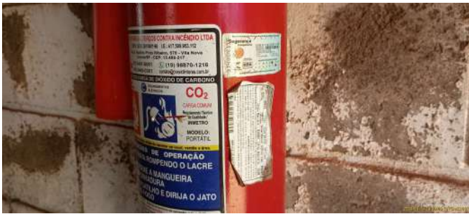
Foto 1 - Extintor de incêndio com a validade expirada do Elevatória de água tratada do Centro de distribuição de água em Cordeirópolis
