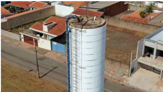
Foto 1 - Tubulações do Reservatório Elevado Jardim Paraty em Cordeirópolis
