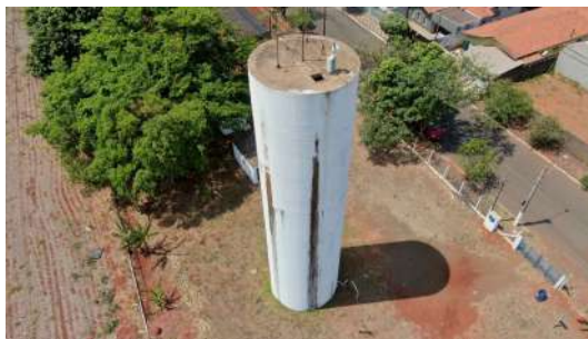
Foto 2 - Para-raios do Reservatório elevado do Jardim Módolo em Cordeirópolis
