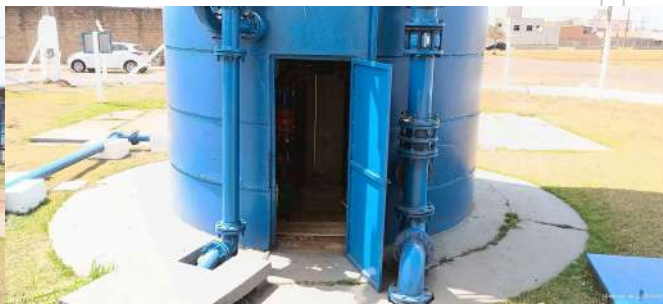
Foto 2 - Entrada da Elevatória de água tratada do Jardim Paraty Elevado em Cordeirópolis
