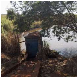
Foto 3 - Entrada da Captação Santa Marina em Cordeirópolis
