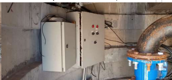
Foto 4 - Painel Elétrico do Elevatória de água tratada do Jardim Paraty Elevado em Cordeirópolis
