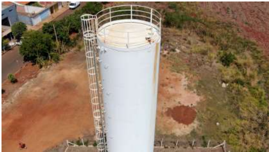
Foto 1 - Guarda-corpo do Reservatório elevado Jardim São Luiz em Cordeirópolis
