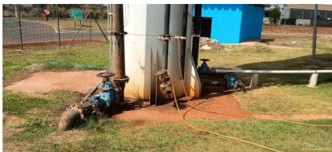
Foto 4 - Tubulação do Reservatório elevado da ETA em Cordeirópolis
