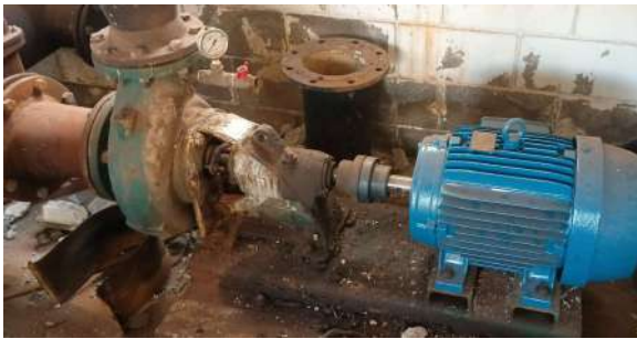
Foto 9 - Bomba da Elevatória de água tratada do Centro de distribuição de água em Cordeirópolis
