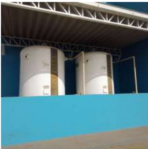
Foto 3 - Tanques de produtos químicos da ETA de Cordeirópolis
