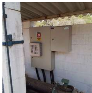
Foto 4 - Painel elétrico da Captação Barro Preto em Cordeirópolis
