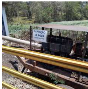
Foto 2 - Bomba da Captação Barro Preto em Cordeirópolis
