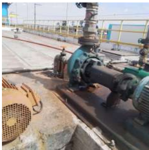
Foto 1 - Vazamento na gaxeta da bomba de uso de água interno do reservatório semi-enterrado da ETA em Cordeirópolis
