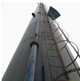
Foto 1 - Para-raios do Reservatório elevado Jardim Cordeiro em Cordeirópolis
