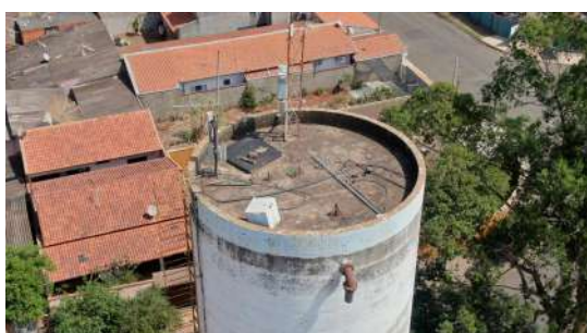
Foto 1 - Tampa de inspeção do Reservatório elevado Jardim Juventude em Cordeirópolis
