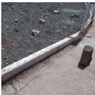
Foto 1 - Alambrado danificado no Reservatório Elevado Jardim Eldorado em Cordeirópolis
