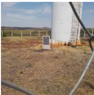
Foto 2 - Placa de identificação do Reservatório elevado Jardim São Luiz em Cordeirópolis
