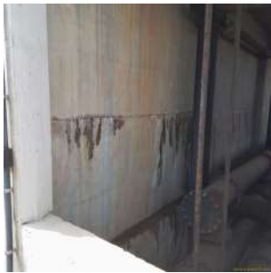
Foto 7 - Vazamento na estrutura dos decantadores e filtros da ETA de Cordeirópolis
