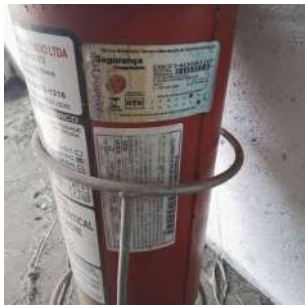
Foto 1 - Extintor de incêndio com a validade expirada da Elevatória de água tratada do Jardim Paraty Apoiado em Cordeirópolis
