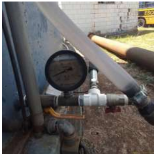
Foto 1 - Manômetro do Reservatório Apoiado Centro de distribuição de água em Cordeirópolis
