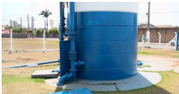
Foto 1 - Entrada da Elevatória de água tratada do Jardim Paraty Elevado em Cordeirópolis
