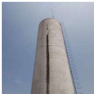
Foto 1 - Vazamentos na estrutura do Reservatório elevado do Jardim Módolo em Cordeirópolis
