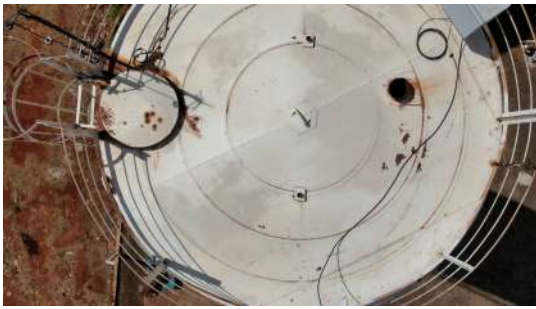
Foto 1 - Tubulação de ventilação sem telas de proteção no Reservatório Elevado Jardim Eldorado em Cordeirópolis
