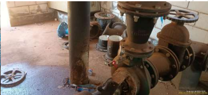
Foto 2 - Materiais estranhos à operação na área interna do Elevatória de água tratada do Centro de distribuição de água em Cordeirópolis
