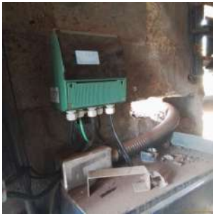
Foto 2 - Medidor de parâmetros da Captação Santa Marina em Cordeirópolis
