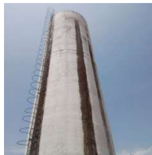
Foto 2 - Vazamentos na estrutura do Reservatório elevado do Jardim Módolo em Cordeirópolis
