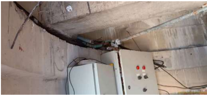
Foto 3 - Fiação exposta na Elevatória de água tratada do Jardim Paraty Elevado em Cordeirópolis
