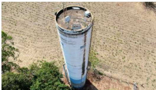
Foto 2 - Inexistência de para-raio do Reservatório elevado Jardim Juventude em Cordeirópolis
