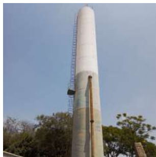
Foto 1 - Vista do Reservatório elevado Jardim Cordeiro em Cordeirópolis
