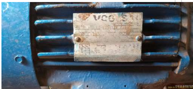
Foto 8 - Bomba da Elevatória de água tratada do Jardim Paraty Elevado em Cordeirópolis
