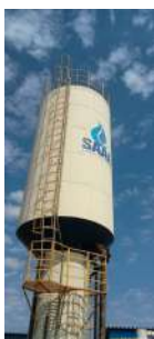
Foto 3 - Guarda-corpo do Reservatório elevado da ETA em Cordeirópolis
