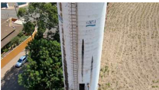
Foto 1 - Vazamentos na estrutura do Reservatório elevado Jardim Juventude em Cordeirópolis
