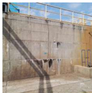
Foto 4 - Vazamento na estrutura dos decantadores e filtros da ETA de Cordeirópolis
