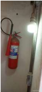
Foto 1 - Extintor de incêndio da Elevatória de água tratada do Jardim Módulo em Cordeirópolis
