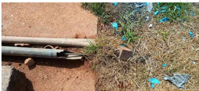
Foto 2 - Cabeamento do para-raios do Reservatório elevado da ETA em Cordeirópolis
