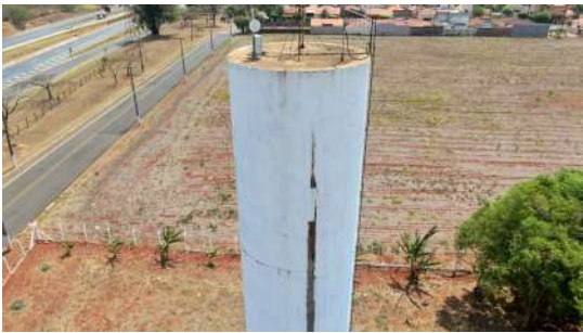
Foto 1 - Ausência de tubulação de ventilação do Reservatório elevado do Jardim Módolo em Cordeirópolis
