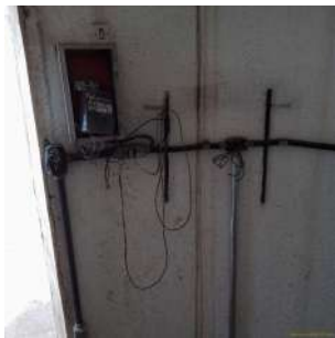
Foto 1 - Fiação exposta e sem segurança do Reservatório elevado Jardim Cordeiro em Cordeirópolis
