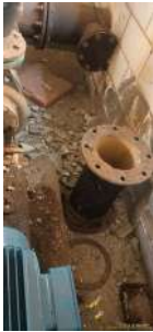
Foto 4 - Materiais estranhos à operação na área interna do Elevatória de água tratada do Centro de distribuição de água em Cordeirópolis
