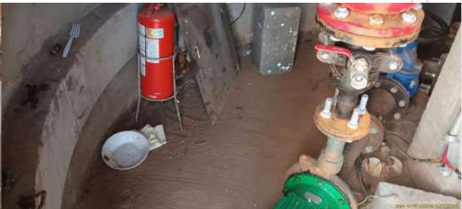
Foto 2 - Materiais estranhos a operação no interior da Elevatória de água tratada do Jardim Paraty Elevado em Cordeirópolis
