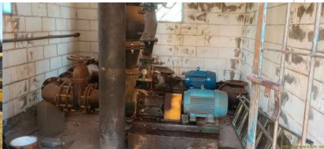
Foto 4 - Vista interna da Elevatória de água tratada do Centro de distribuição de água em Cordeirópolis
