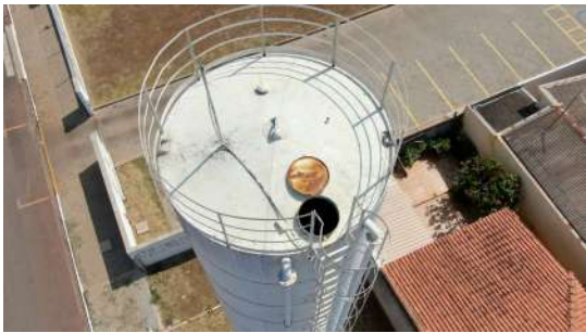
Foto 1 - Para-raios do Reservatório elevado Jardim Lise em Cordeirópolis
