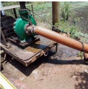
Foto 2 - Vazamento na gaxeta da bomba da Captação Barro Preto em Cordeirópolis
