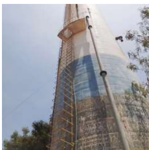
Foto 1 - Guarda-corpo do Reservatório elevado Jardim Juventude em Cordeirópolis
