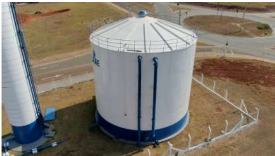
Foto 1 - Tubulação de entrada e extravasor do Reservatório Apoiado Jardim Paraty em Cordeirópolis
