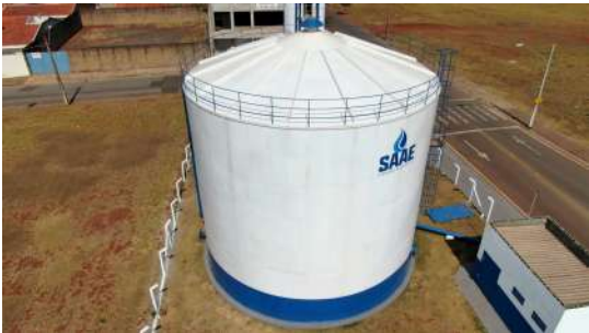
Foto 1 - Guarda-corpo do Reservatório Apoiado Jardim Paraty em Cordeirópolis
