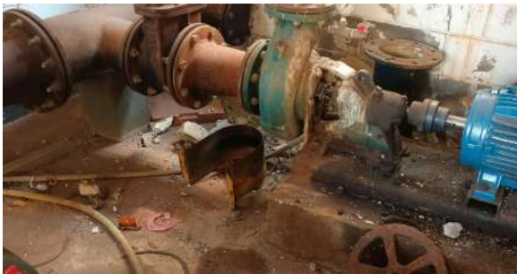
Foto 1 - Materiais estranhos à operação na área interna do Elevatória de água tratada do Centro de distribuição de água em Cordeirópolis
