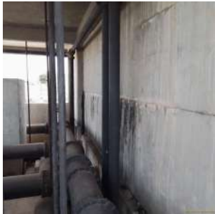
Foto 10 - Vazamento na estrutura dos decantadores e filtros da ETA de Cordeirópolis
