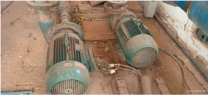
Foto 4 - Bombas da Elevatória de água tratada do Jardim Módulo em Cordeirópolis
