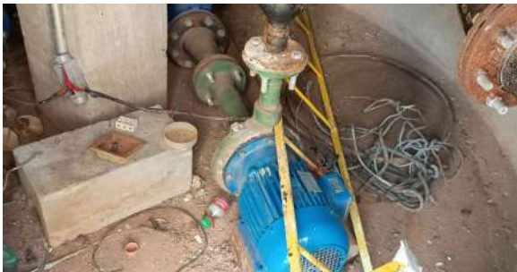
Foto 1 - Materiais estranhos a operação no interior da Elevatória de água tratada do Jardim Paraty Elevado em Cordeirópolis
