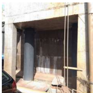
Foto 3 - Vazamento na estrutura dos decantadores e filtros da ETA de Cordeirópolis
