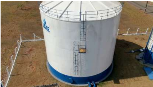
Foto 2 - Guarda-corpo do Reservatório Apoiado Jardim Paraty em Cordeirópolis
