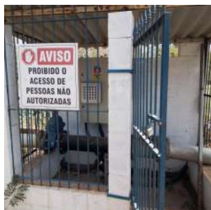
Foto 3 - Tubulação de água da Captação Barro Preto em Cordeirópolis
