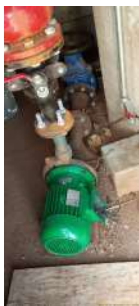
Foto 5 - Bomba da Elevatória de água tratada do Jardim Paraty Elevado em Cordeirópolis
