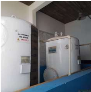
Foto 6 - Tanques de produtos químicos da ETA de Cordeirópolis
