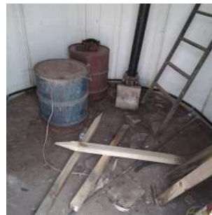
Foto 2 - Ausência de limpeza no Reservatório elevado Jardim Cordeiro em Cordeirópolis
