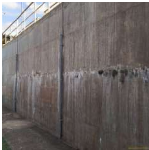
Foto 8 - Vazamento na estrutura dos decantadores e filtros da ETA de Cordeirópolis
