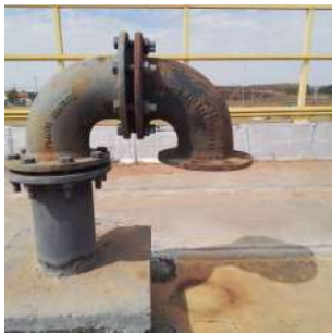
Foto 1 - Inexistência de telas de proteção do reservatório semi-enterrado da ETA em Cordeirópolis
