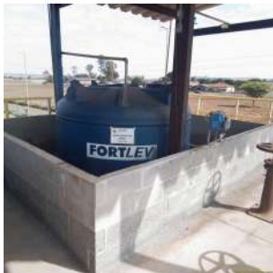
Foto 1 - Etapa de desinfecção da ETA de Cordeirópolis
