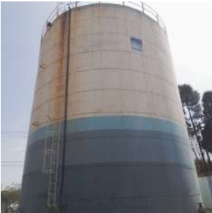
Foto 2 - Vista do Reservatório Apoiado Centro de distribuição de água em Cordeirópolis
