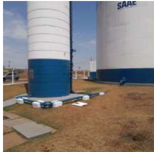
Foto 5 - Tubulações do Reservatório Elevado Jardim Paraty em Cordeirópolis
