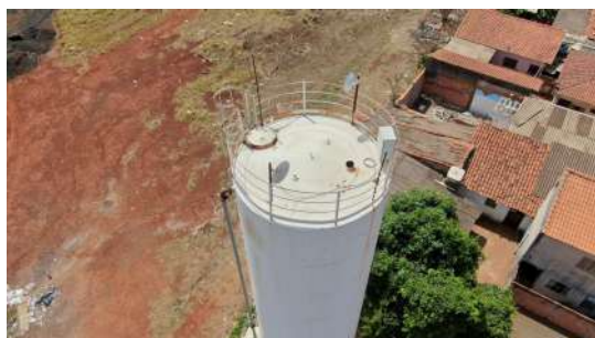
Foto 1 - Para-raios do Reservatório Elevado Jardim Eldorado em Cordeirópolis
