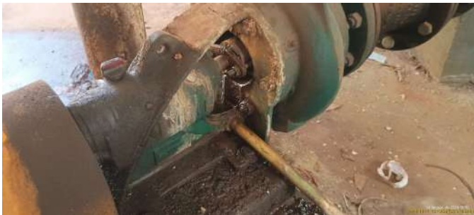
Foto 1 - Vazamento na gaxeta da bomba da Elevatória de água tratada do Centro de distribuição de água em Cordeirópolis
