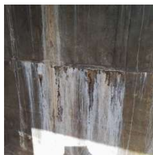
Foto 2 - Vazamento na estrutura dos decantadores e filtros da ETA de Cordeirópolis
