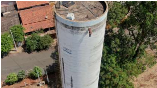
Foto 1 - Tubulação de ventilação sem telas de proteção do Reservatório elevado Jardim Juventude em Cordeirópolis
