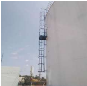
Foto 2 - Guarda-corpo do Reservatório Apoiado Jardim Paraty em Cordeirópolis
