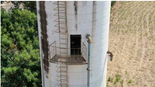
Foto 2 - Tubulação de ventilação sem telas de proteção do Reservatório elevado Jardim Juventude em Cordeirópolis
