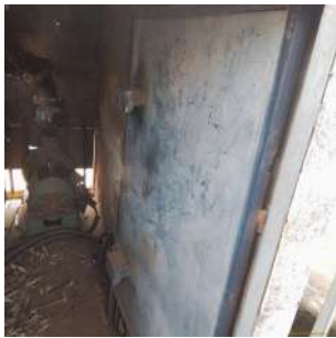
Foto 1 - Ausência de identificação da Captação Santa Marina em Cordeirópolis
