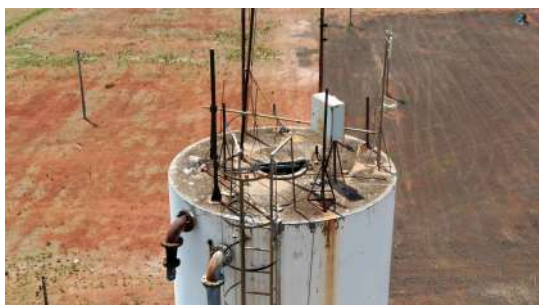
Foto 1 - Tela de proteção na tubulação de ventilação do Reservatório elevado Jardim Cordeiro em Cordeirópolis
