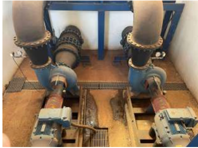
Foto 12 - Vazamento na bomba da ETA de Cordeirópolis
