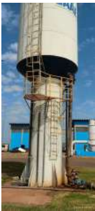
Foto 2 - Guarda-corpo do Reservatório elevado da ETA em Cordeirópolis
