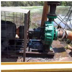
Foto 1 - Vazamento na gaxeta da bomba da Captação Barro Preto em Cordeirópolis
