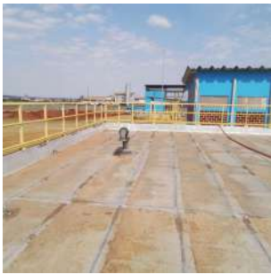
Foto 2 - Inexistência de telas de proteção do reservatório semi-enterrado da ETA em Cordeirópolis
