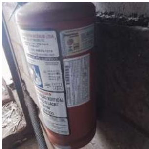
Foto 1 - Extintor de incêndio da Captação Santa Marina em Cordeirópolis
