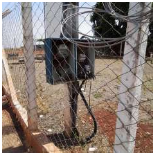
Foto 1 - Cabos sem caixa de proteção no Reservatório Elevado Jardim Eldorado em Cordeirópolis
