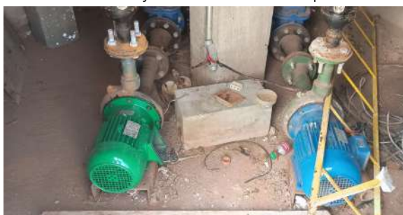
Foto 3 - Vista interna do Elevatória de água tratada do Jardim Paraty Elevado em Cordeirópolis
