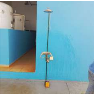
Foto 2 - Chuveiro de emergência da ETA de Cordeirópolis
