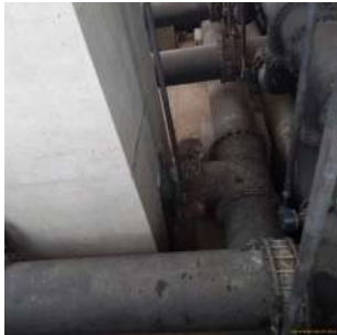
Foto 9 - Vazamento na tubulação de saída da água tratada da ETA de Cordeirópolis
