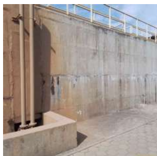
Foto 5 - Vazamento na estrutura dos decantadores e filtros da ETA de Cordeirópolis
