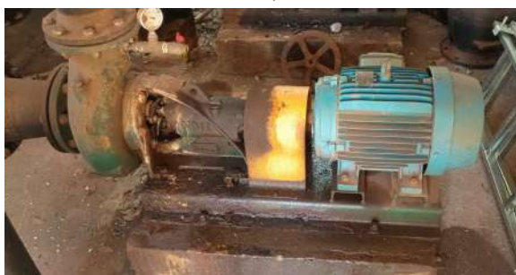
Foto 7 - Bomba da Elevatória de água tratada do Centro de distribuição de água em Cordeirópolis
