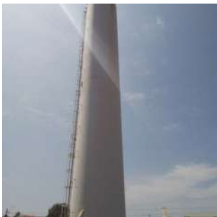
Foto 4 - Guarda-corpo do Reservatório elevado Jardim São Luiz em Cordeirópolis
