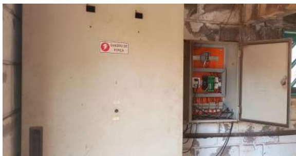
Foto 5 - Painel elétrico da Elevatória de água tratada do Centro de distribuição de água em Cordeirópolis
