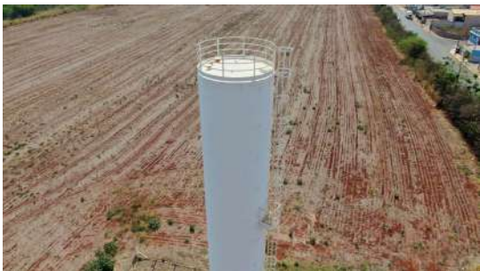
Foto 1 - Inexistência de para-raios do Reservatório elevado Jardim São Luiz em Cordeirópolis
