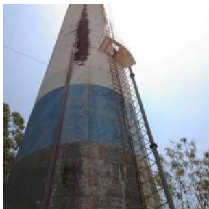
Foto 1 - Sem cabeamento de para-raio do Reservatório elevado Jardim Juventude em Cordeirópolis
