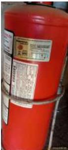
Foto 1 - Extinto de incêndio com validade expirada da Elevatória de água tratada do Jardim Paraty Elevado em Cordeirópolis
