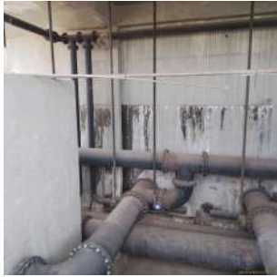
Foto 11 - Vazamento na estrutura dos decantadores e filtros da ETA de Cordeirópolis
