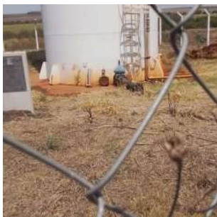
Foto 5 - Manômetro do Reservatório elevado Jardim São Luiz em Cordeirópolis
