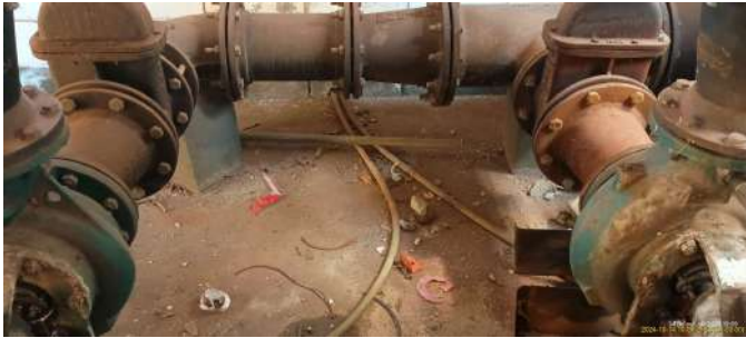
Foto 3 - Materiais estranhos à operação na área interna do Elevatória de água tratada do Centro de distribuição de água em Cordeirópolis
