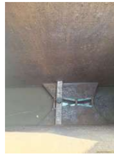
Foto 4 - Medidor Parshall na entrada do esgoto e medidor de vazão ultrassônico - ETE São Bento do Recreio
