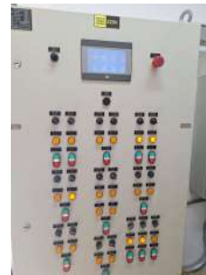
Foto 6 - Painel de controle dos reatores - ETE São Bento do Recreio
