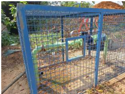
Foto 1 - Poço São Bento do Recreio 5- cavalete
