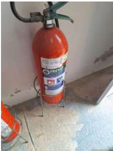
Foto 2 - Validade regular - extintor de incêndio (2)
