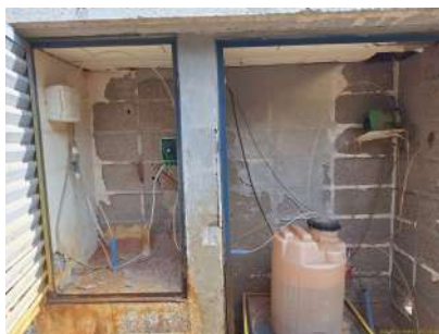
Foto 3 - Dosagem de hipoclorito de Sódio - Reservatório São Bento do Recreio
