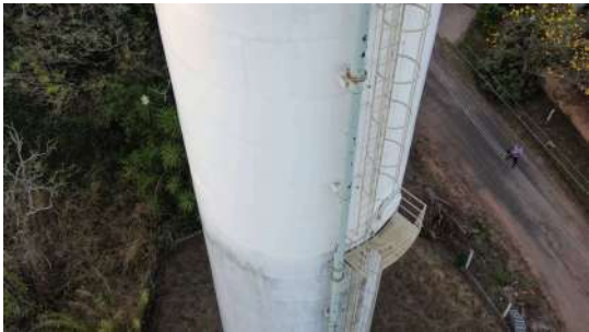
Foto 3 - Reservatório Vale Verde 2 - descida do para-raios 2
