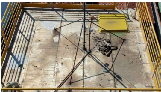
Foto 1 - Reservatório Santa Maria - Tampa de inspeção
