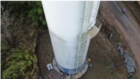
Foto 4 - Reservatório Vale Verde 2 - descida do para-raios 3
