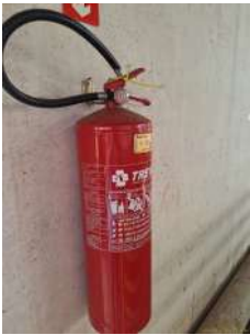
Foto 1 - Extintor na área de entrada do esgoto
