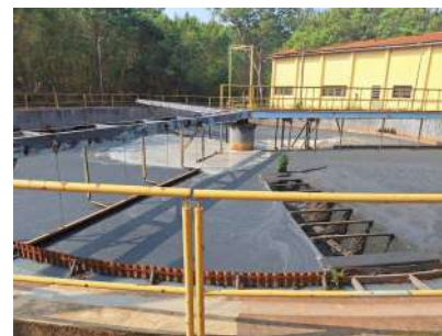
Foto 6 - Unidade de flotação por ar dissolvido - flotador circular
