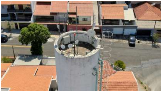
Foto 1 - Para-raios - Reservatório Nova Espírito Santo
