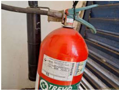
Foto 1 - Extintor de incêndio - validade regular - Poço P8 Vale Verde
