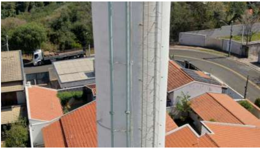
Foto 2 - Não conformidade - Ausência de aterramento do para-raios
