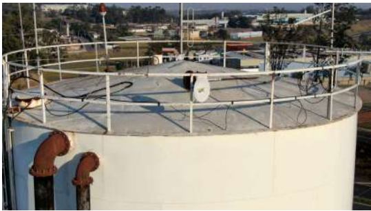
Foto 1 - Reservatório Country Club - para-raios caído
