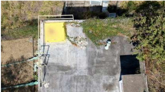
Foto 1 - Reservatório Parque Portugal 2 - Enfoque: crescimento descontrolado de trepadeira
