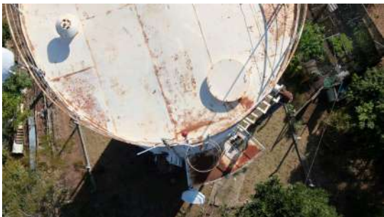
Foto 1 - Reservatório Colina dos Pinheiros - tampa de inspeção e ventilação
