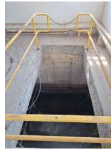
Foto 2 - Entrada do esgoto bruto, pré-gradeamento
