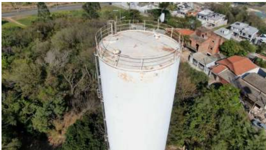
Foto 1 - Reservatório Colina dos Pinheiros - para-raios
