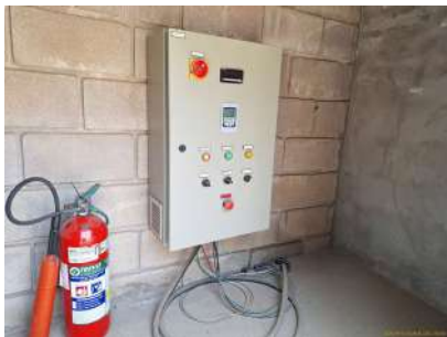
Foto 3 - Painel de acionamento da bomba
