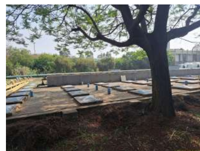
Foto 10 - Reatores UASB Submersos
