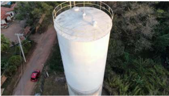
Foto 1 - Reservatório Vale Verde 2 - ventilação do para-raios
