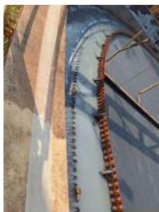
Foto 7 - Vertedor de saída do efluente tratado
