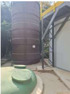
Foto 2 - Cilos de armazenamento de lodo - ETE São Bento do Recreio
