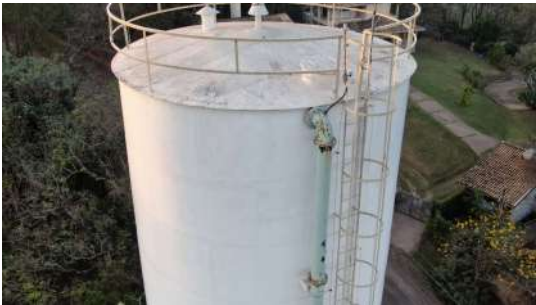
Foto 2 - Reservatório Vale Verde 2 - descida do para-raios 1
