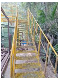
Foto 1 - Escada para acesso aos reatores
