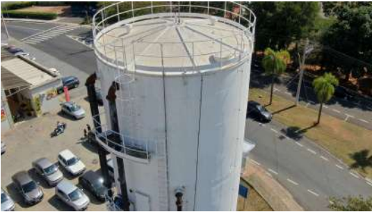
Foto 2 - Reservatório Le Village - descida de aterramento
