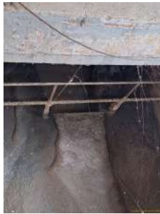
Foto 1 - Entrada de esgoto bruto - medidor parshall afogado
