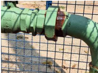
Foto 1 - Local com marcação de oxidação, onde há gotejamento
