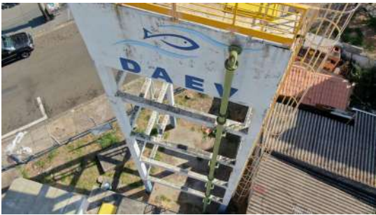
Foto 1 - Reservatório Santa Maria - extravasor
