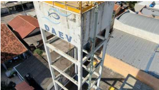
Foto 2 - Reservatório Santa Maria - ausência de descida do para-raios
