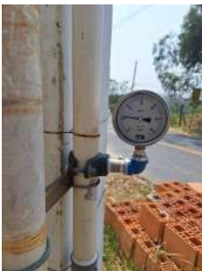
Foto 2 - Manômetro sob o Reservatório Sítio Diadema
