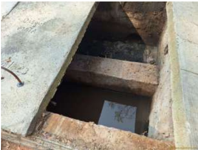
Foto 1 - Entrada de esgoto com retenção de resíduos
