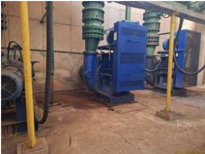
Foto 1 - Dois conjuntos instalados e um reserva
