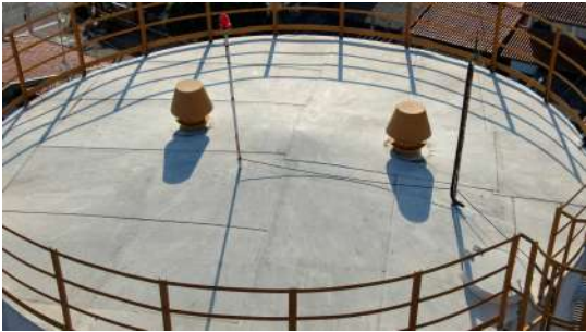
Foto 1 - Reservatório Morada do Sol - Para-raios e ventilação
