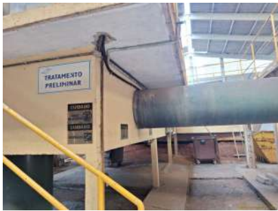
Foto 11 - Galpão com unidades do tratamento preliminar
