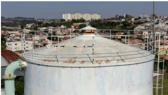
Foto 1 - Reservatório Cerejeiras - ausência de telas de proteção
