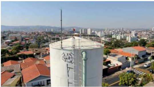
Foto 1 - Reservatório Cerejeiras - para-raios
