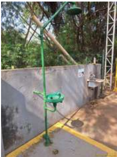
Foto 1 - Chuveiro de emergência - área de preparação de polímeros
