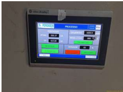
Foto 3 - Dosagem de peróxido de hidrogênio - flotação por ar dissolvido
