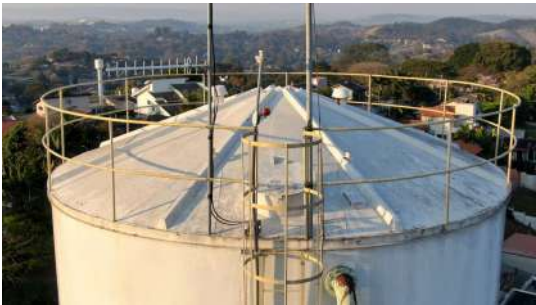
Foto 2 - Reservatório Vale Verde 1 - descida do para-raios e tampa de inspeção
