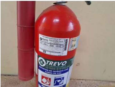
Foto 1 - Extintor de incêndio com validade regular - Estação Elevatória Bosque da Mata
