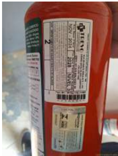
Foto 1 - Validade regular - extintor de incêndio
