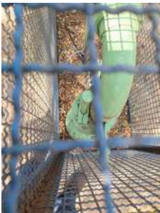
Foto 1 - Tubo medidor de nível (centro da foto)
