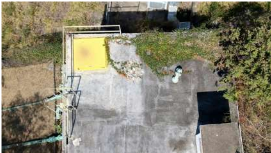
Foto 1 - Reservatório Parque Portugal 2 - tampa regular
