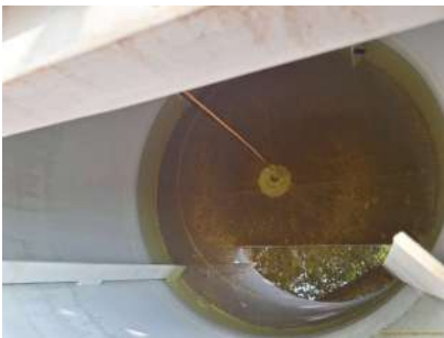
Foto 2 - Tanque hipoclorito de sódio
