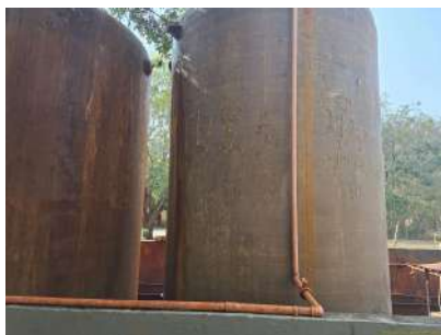
Foto 5 - Acondicionamento de cloreto férrico
