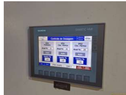
Foto 4 - Dosagem cloreto férrico - flotação por ar dissolvido
