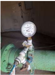
Foto 1 - Manômetro - Reservatório São Bento do Recreio
