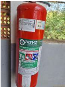
Foto 3 - Extintor na área de preparação de polímero
