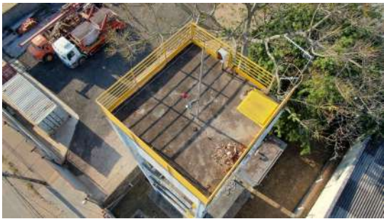
Foto 1 - Reservatório San Fernando - Ausência de descida do para-raios (aterramento)
