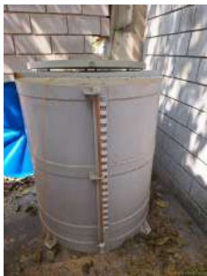
Foto 1 - Armazenamento de hipoclorito de sódio
