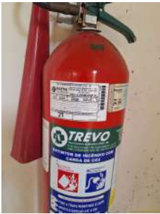
Foto 2 - Extintor de incêndio com carga de CO2, área de entrada do esgoto
