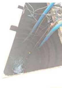
Foto 1 - Bombas submersas instaladas - Elevatória da ETE São Bento do Recreio
