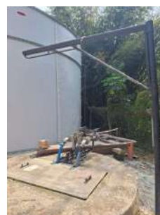
Foto 2 - Acesso para manutenção das bombas instaladas da ETE São Bento do Recreio
