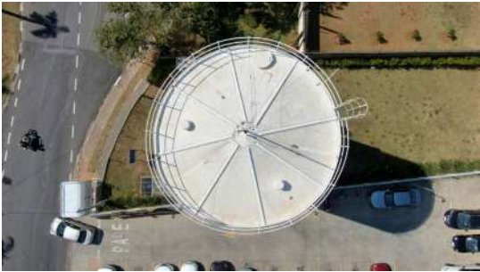
Foto 1 - Reservatório Le Village - Tampa, para-raios e ventilação
