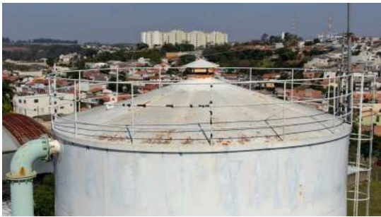
Foto 1 - Reservatório Cerejeiras - ventilação
