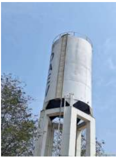
Foto 1 - Ausência de guarda-corpo na escada
