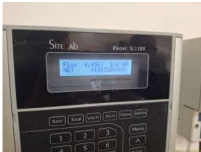
Foto 5 - Painel de medição de vazão - ETE São Bento do Recreio
