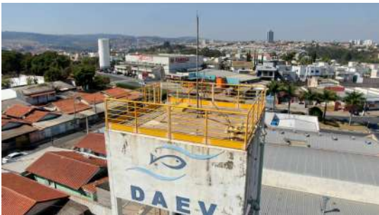
Foto 1 - Reservatório Santa Maria - para-raios
