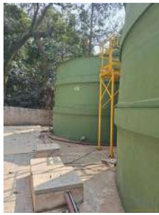
Foto 3 - Tanques de aerção mais antigos - ETE São Bento do Recreio
