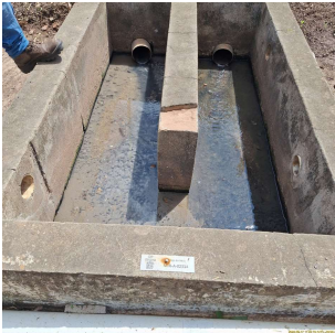
Foto 1 - Chegada - esgoto bruto
