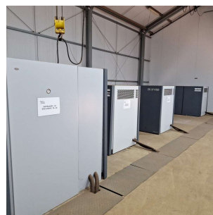
Foto 9 - Galpão com sopradores _ sistema de aeração
