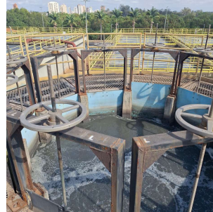
Foto 5 - Caixa de distribuição do esgoto bruto reatores e lagoa de aeracao
