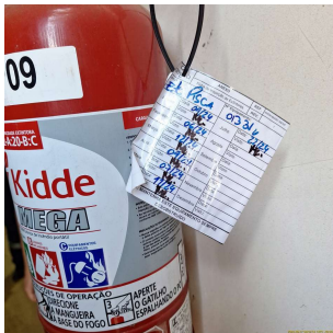
Foto 1 - Amostra de extintor de incêndio com validade regular
