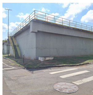
Foto 2 - Indicação do reator com vazamento
