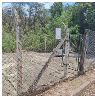
Foto 1 - Ausência de identificação - placa quebrada no momento da inspeção
