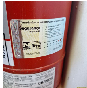
Foto 2 - Amostra de extintor de incêndio com validade regular (2)
