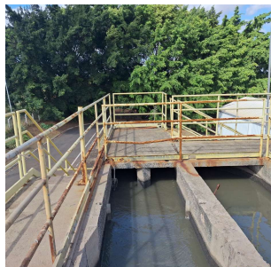
Foto 1 - Guarda-corpos em estado de oxidação
