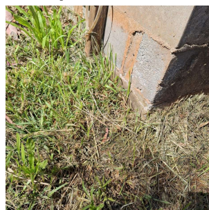
Foto 4 - Solo encharcado - vazamento de esgoto
