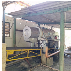
Foto 18 - Centrífuga para separação do lodo
