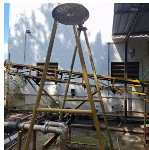
Foto 19 - Chuveiro de emergência - funcionando
