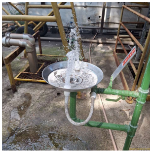
Foto 20 - Lavador de olhos - funcionando
