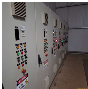
Foto 13 - Painéis de controle - aeração
