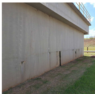
Foto 3 - Marcas de vazamento - outro reator
