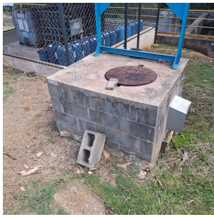
Foto 5 - Caixa de passagem - local com vazamento de esgoto no solo
