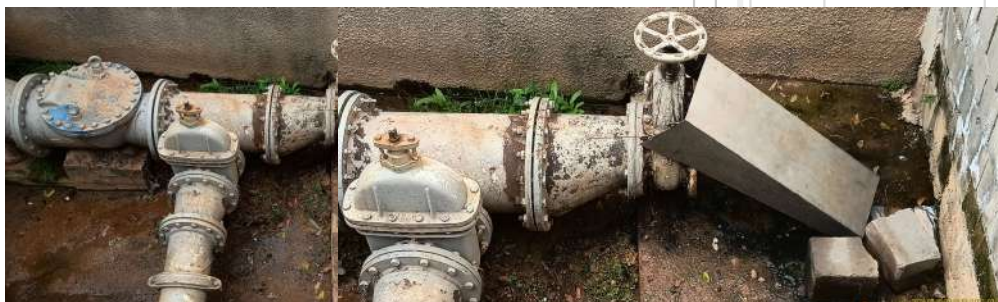
Foto 1 - Vazamento no barrilete de recalque.
