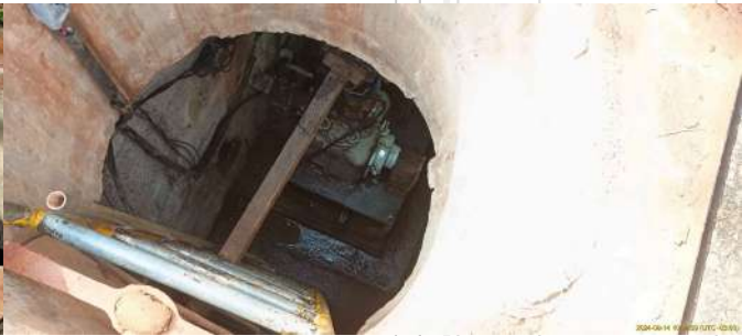
Foto 8 - Poço seco dos conjuntos motobomba.
