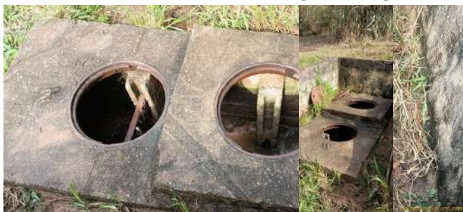
Foto 3 - Poços de chegada e gradeamento da EEE.
