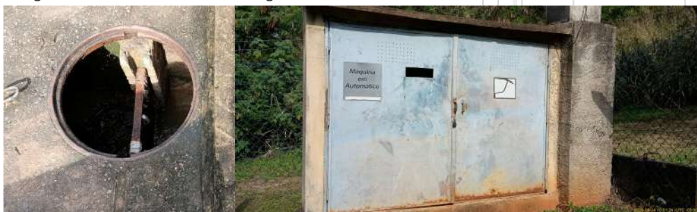
Foto 5 - Poços de chegada e gradeamento da EEE.
