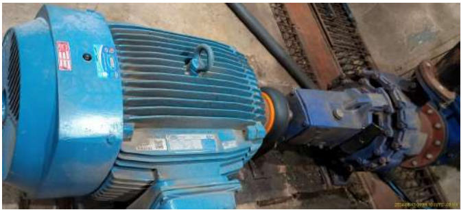
Foto 15 - Primeiro conjunto motobomba.
