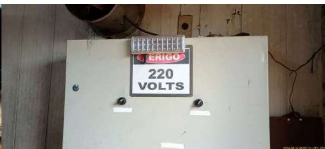
Foto 8 - Painel elétrico e de comando.
