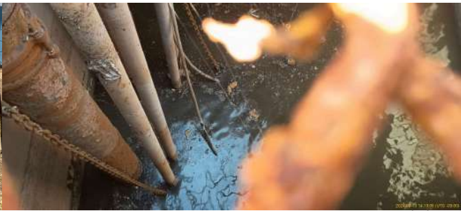
Foto 10 - Vista interna do poço de sucção com motobombas submersas.
