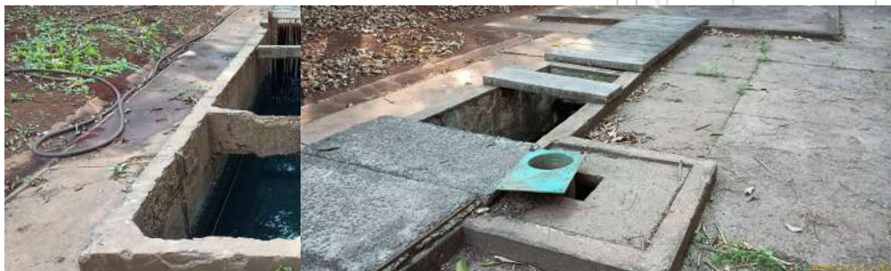
Foto 1 - Ausência de guarda-corpo no entorno do canal de chegada do esgoto e gradeamento ou de tampas/grades horizontais, impedindo quedas e acidentes.
