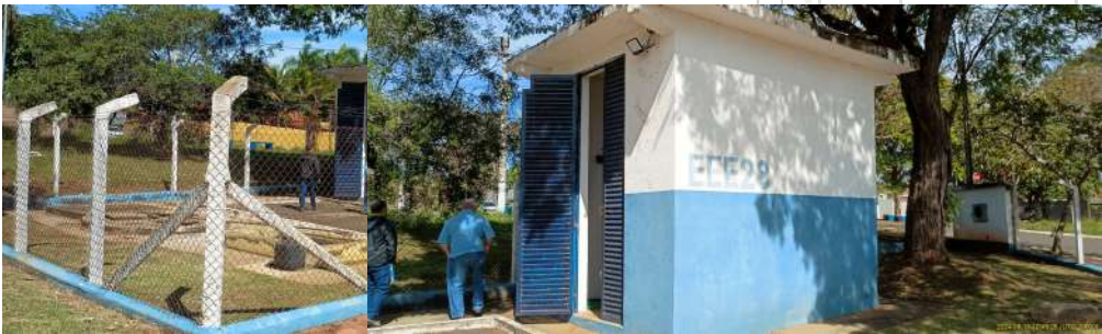
Foto 1 - Vista geral externa da EEE. Foto 2 - Abrigo do gerador de energia a diesel.
