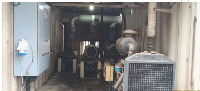
Foto 7 - Vista geral interna do abrigo dos conjuntos motobomba.
