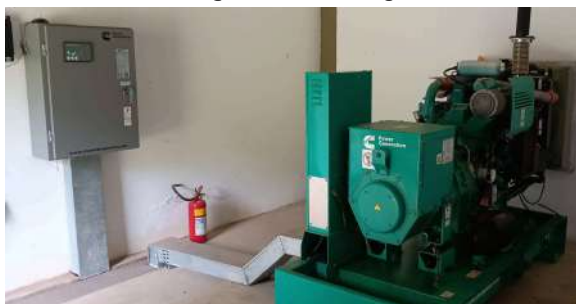
Foto 5 - Pannel elétrico e de comando e gerador de energia a diesel.
