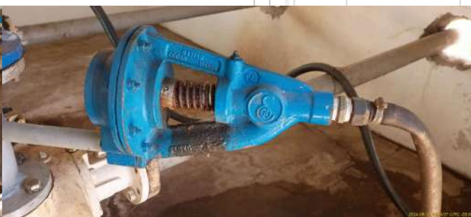
Foto 2 - Detalhe do vazamento na mola.
