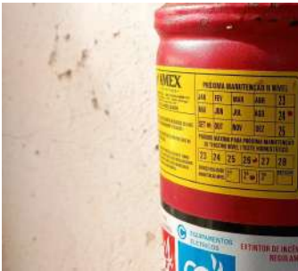
Foto 1 - Validade do extintor com prazo adequado.
