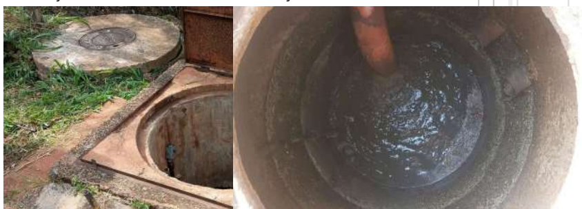
Foto 9 - Poço seco dos conjuntos motobomba.
