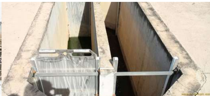
Foto 8 - Canais desarenador da EEE.
