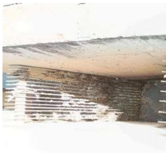
Foto 7 - Canal de gradeamento do esgoto.
