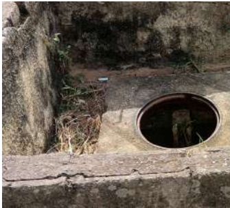
Foto 1 - Ausência de tampas ou grades para fechar as aberturas do local de gradeamento quando não estiver ocorrendo a limpeza do material retido.
