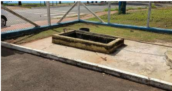
Foto 1 - Ausência de grade ou guarda-corpo no poço de acesso ao gradeamento.
