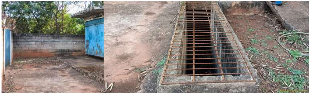
Foto 3 - Vista interna da EEE. Foto 4 - Canal de chegada do esgoto.
