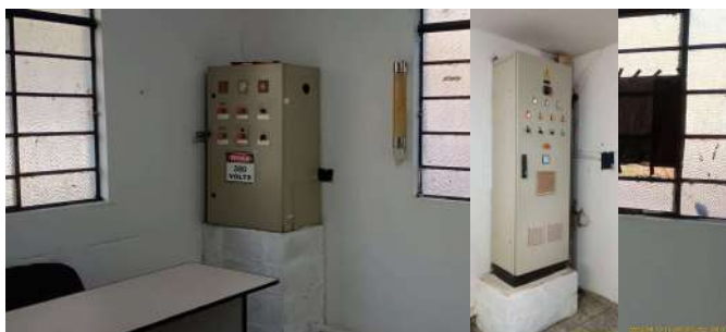
Foto 9 - Painelelétrico da EEE.
