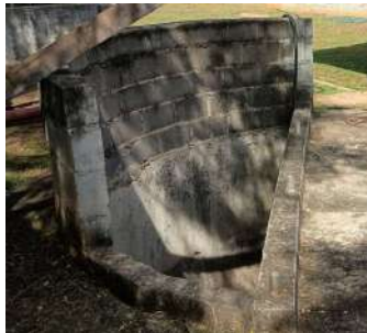
Foto 3 - Ausência de guarda-corpo ou grade horizontal no espaço do poço de sucção.
