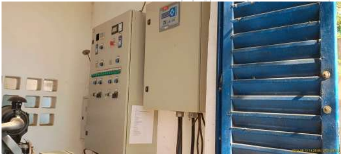
Foto 10 - Painel elétrico e de comando.
