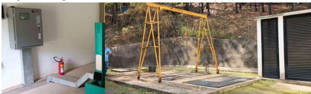
Foto 5 - Painelelétrico e de comando e gerador de energia a diesel.
