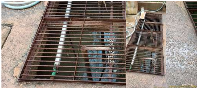
Foto 1 - Poço de sucção, com apenas uma bomba instalada (apenas uma corrente de sustentação presente).
