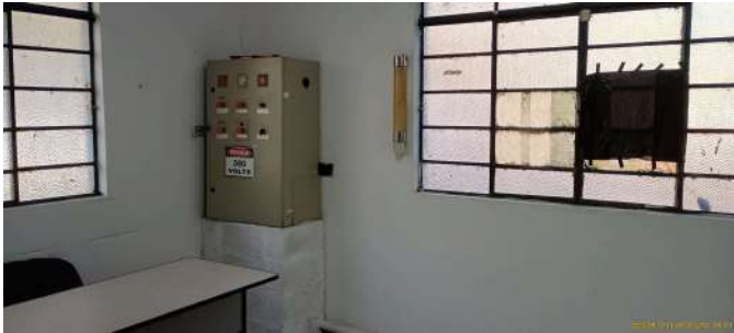
Foto 9 - Painel elétrico da EEE.
