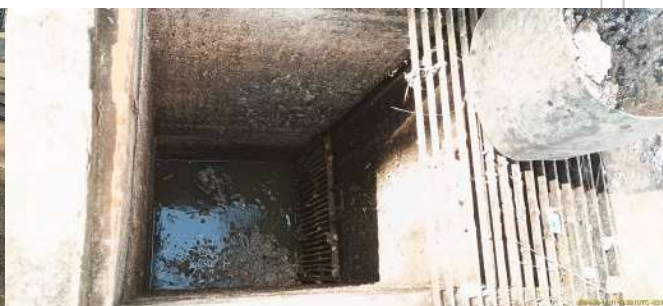
Foto 8 - Poço de chegada do esgoto e gradeamento.
