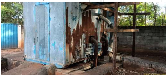
Foto 6 - Abrigo das máquinas e do painel elétrico e de comando.
