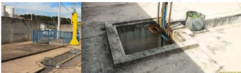
Foto 3 - Vista geral interna da EEE.
