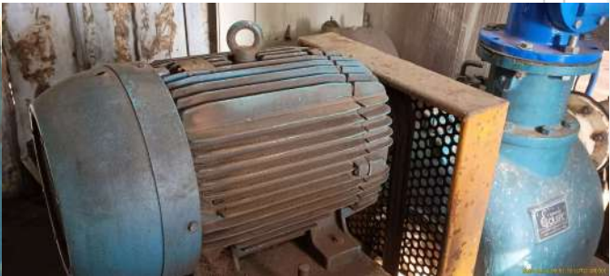
Foto 13 - Motor de um dos conjuntos motobomba.
