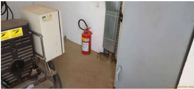
Foto 1 - Extintor de incêndio do local.
