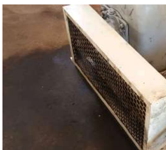
Foto 10 - Motor do segundo conjunto motobomba.
