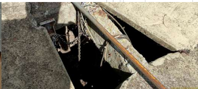
Foto 10 - Vão com correntes da EEE.
