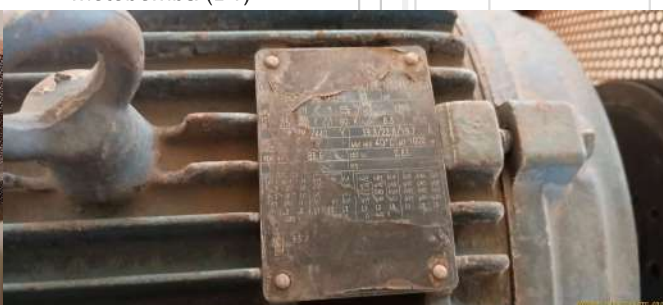
Foto 14 - Placa de especificações técnicas do motor do segundo conjunto motobomba (B2).
