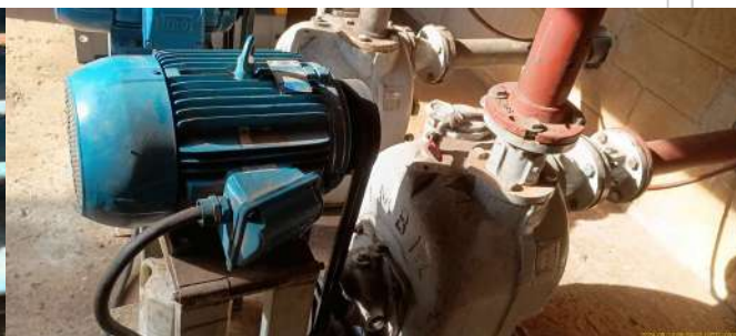
Foto 14 - Segundo conjunto motobomba.
