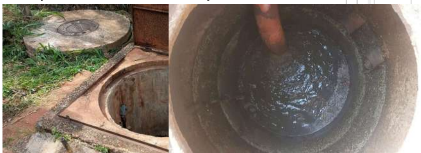
Foto 9 - Poço seco dos conjuntos motobomba.
