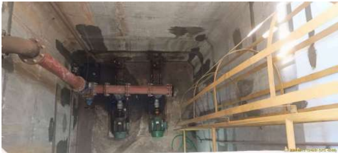
Foto 10 - Vista do poço (seco) dos conjuntos motobomba da EEE.
