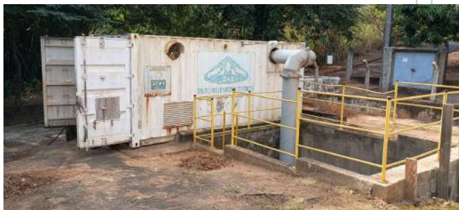
Foto 5 - Abrigo dos conjuntos motobomba.
