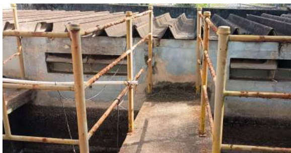
Foto 3 - Situação dos guarda-corpo dos tanques de sucção.
