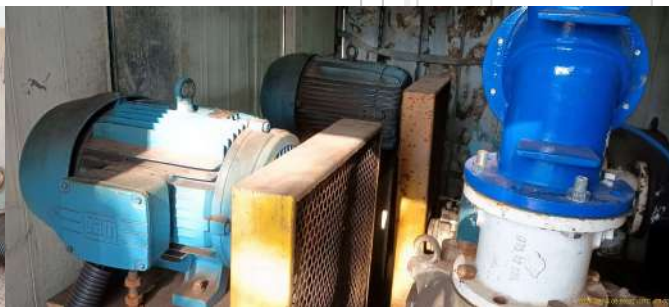
Foto 10 - Conjuntos motobomba da EEE (1+1R).
