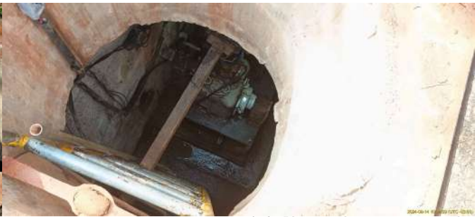
Foto 8 - Poço seco dos conjuntos motobomba.
