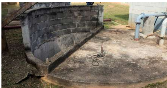
Foto 7 - Poço de sucção.
