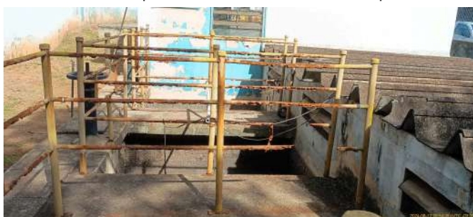
Foto 7 - Situação dos guarda-corpo dos tanques de sucção.
