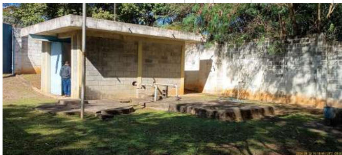
Foto 3 - Vista geral interna da EEE.
