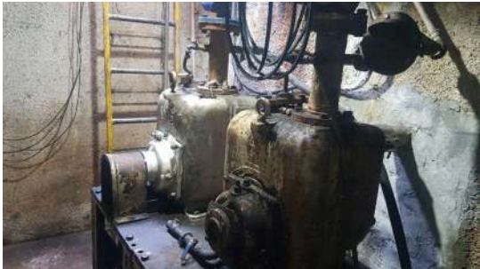
Foto 11 - Conjuntos girantes da EEE (apenas um está acoplado a motor elétrico). (Fonte: DAE Americana, 30/08/2024).
