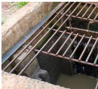
Foto 7 - Local de chegada do esgoto e gradeamento.
