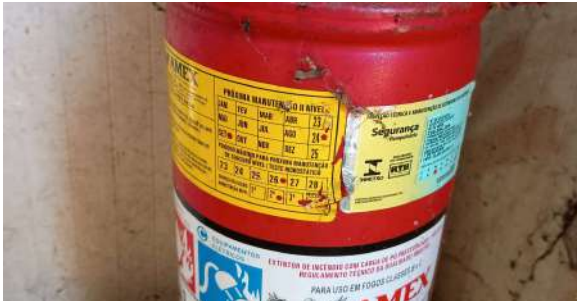
Foto 1 - Validade do extintor dentro do prazo regular.
