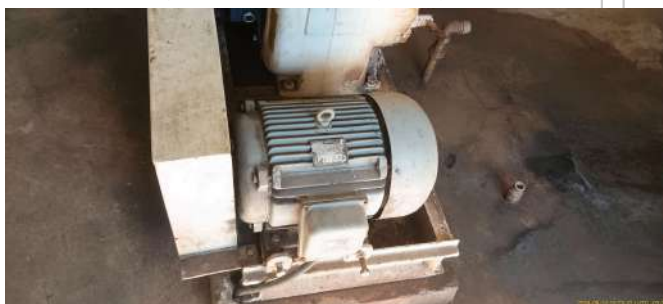
Foto 8 - Motor do primeiro conjunto motobomba.
