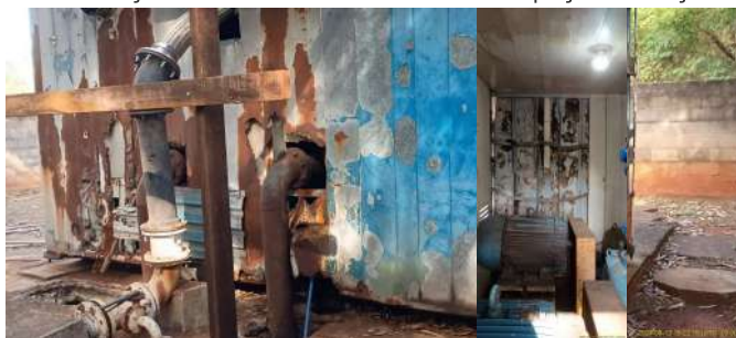
Foto 3 - Tubulações de sucção.
