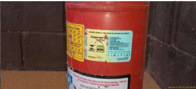
Foto 2 - Validade do extintor de incêndio dentro do prazo adequado.
