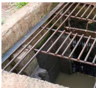
Foto 7 - Local de chegada do esgoto e gradeamento.
