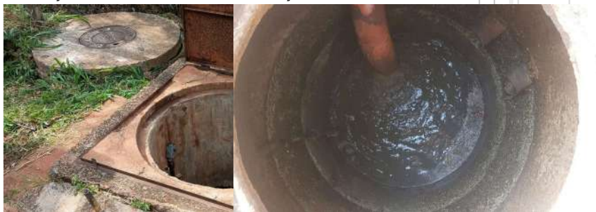
Foto 9 - Poço seco dos Foto 10 - Poço de sucção conjuntos motobomba. (Fonte: DAE Americana, 30/08/2024).
