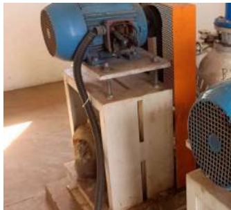
Foto 1 - Exposição dos fios da ligação elétrica dos motores.
