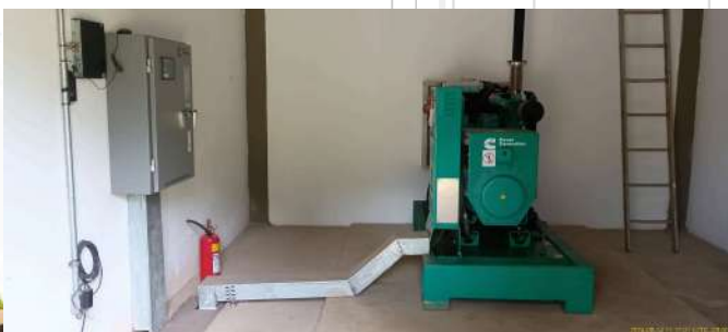
Foto 4 - Painelelétrico e de comando e gerador de energia a diesel.
