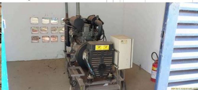
Foto 7 - Gerador de energia a diesel.
