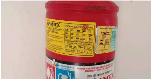
Foto 1 - Validade do extintor de incêndio.
