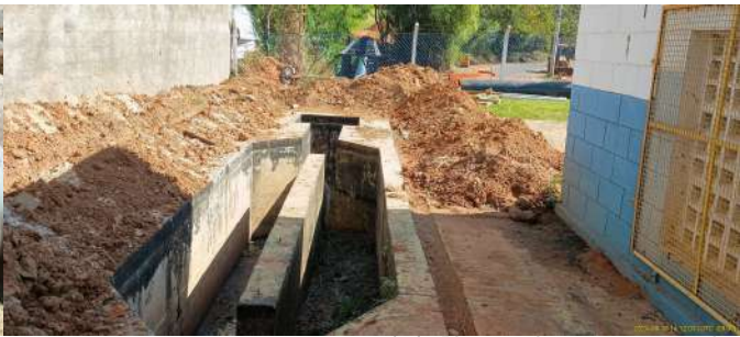
Foto 7 - Canal desarenador da EEE.
