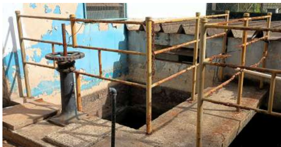
Foto 1 - Situação dos guarda-corpo dos tanques de sucção.
