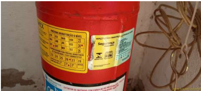
Foto 1 - Validade do extintor com prazo adequado.
