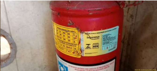
Foto 2 - Validade do extintor dentro do prazo regular.
