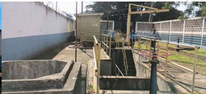
Foto 4 - Vista geral interna da EEE.
