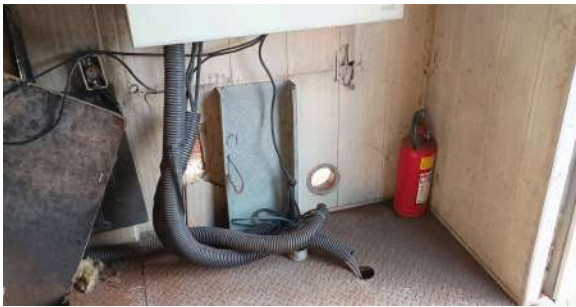
Foto 9 - Extintor de incêndio no piso, dentro do abrigo da EEE.
