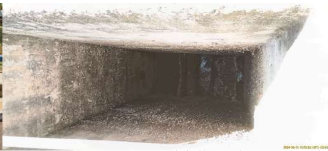
Foto 4 - Vista interna do gradeamento grosseiro.
