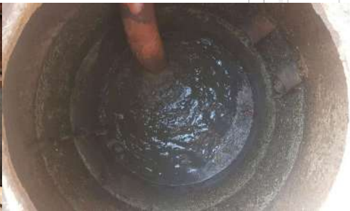
Foto 10 - Poço de sucção (Fonte: DAE Americana, 30/08/2024).
