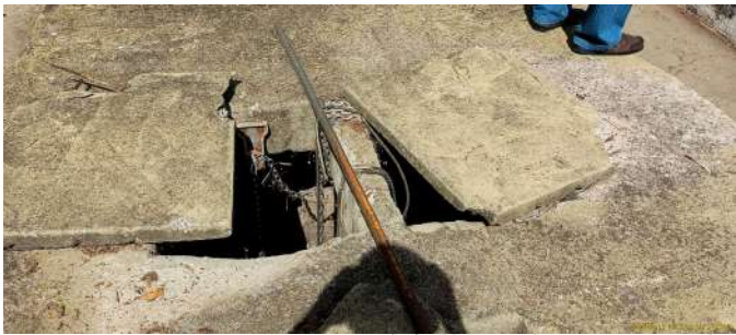
Foto 11 - Vão com correntes de sustentação das bombas submersas instaladas.
