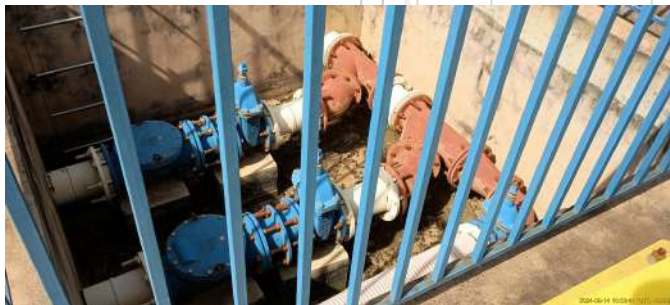
Foto 10 - Barrilete da EEE.
