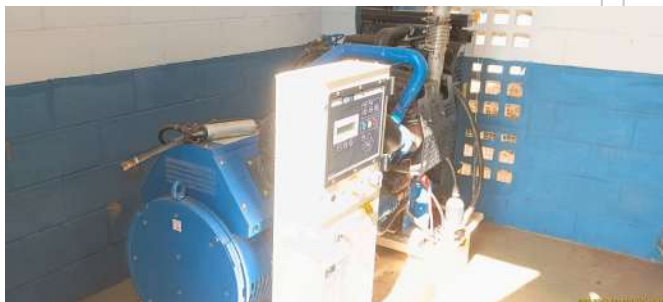
Foto 5 - Gerador de energia elétrica a diesel.
