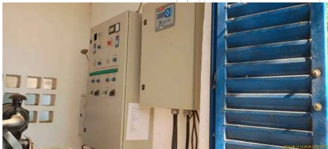
Foto 10 - Painel elétrico e de comando.
