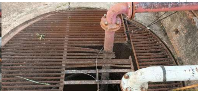
Foto 8 - Poço de sucção, com detalhes da grade de proteção
