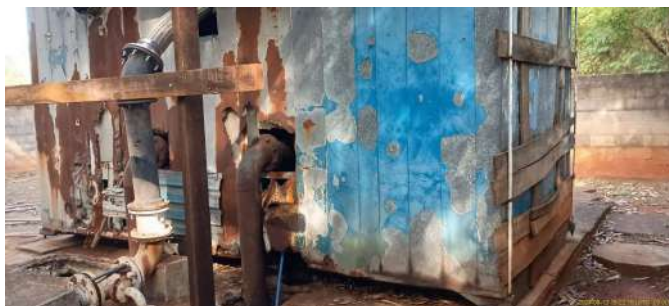
Foto 3 - Tubulações de sucção.
