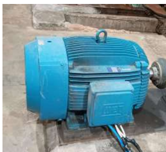
Foto 16 - Segundo conjunto motobomba.
