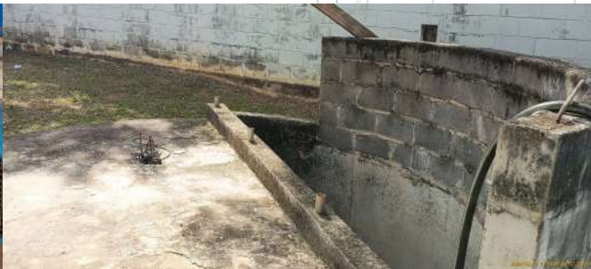
Foto 2 - Ausência de guarda-corpo ou grade horizontal no espaço do poço de sucção.
