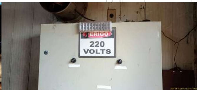
Foto 8 - Painel elétrico e de comando.
