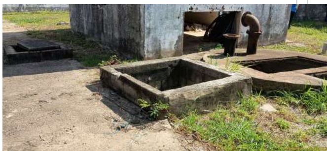
Foto 2 - Poço de sucção e caixa de registros da tubulação.
