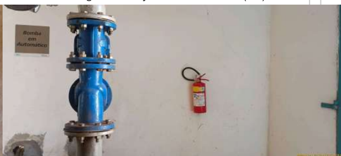
Foto 16 - Extintor de incêndios dentro do abrigo dos conjuntos motobomba.
