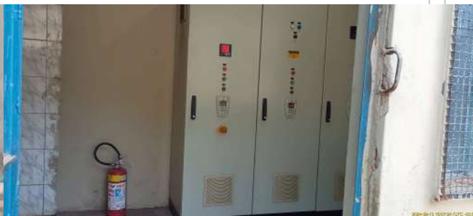
Foto 10 - Pannel elétrico e de comando da EEE e extintor de incêndio.
