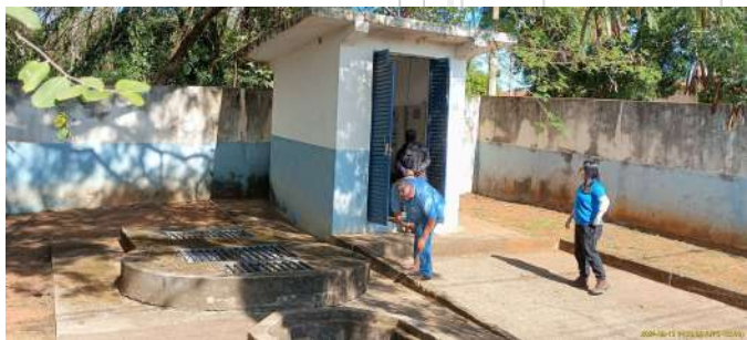
Foto 3 - Vista geral interna da EEE.
