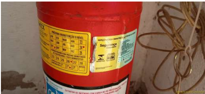
Foto 1 - Validade do extintor com prazo adequado.
