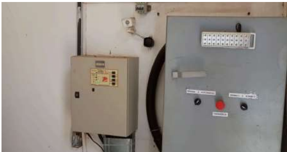
Foto 8 - Painéis elétricos e de comando da EEE.
