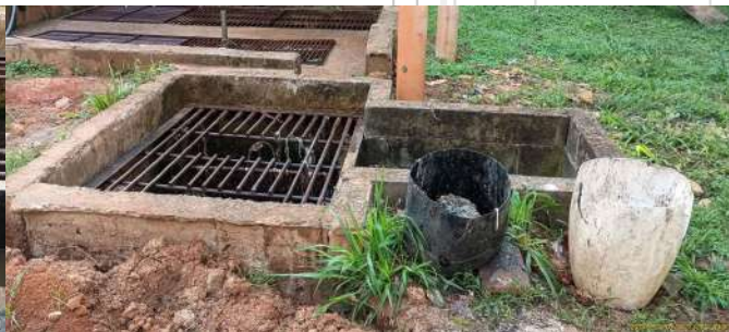
Foto 6 - Local de chegada do esgoto e gradeamento. Tambores utilizados para transporte do material retido nas grades.
