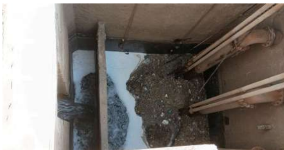
Foto 7 - Poço de sucção, com motobomba submersas.
