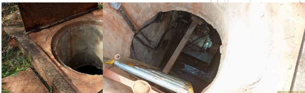
Foto 7 - Poço seco dos conjuntos motobomba.
