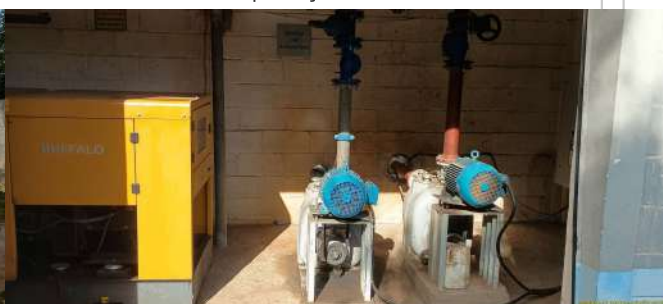
Foto 10 - Conjuntos motobomba e gerador de energia a diesel.
