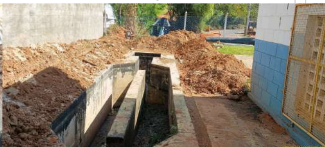
Foto 7 - Canal desarenador da EEE.
