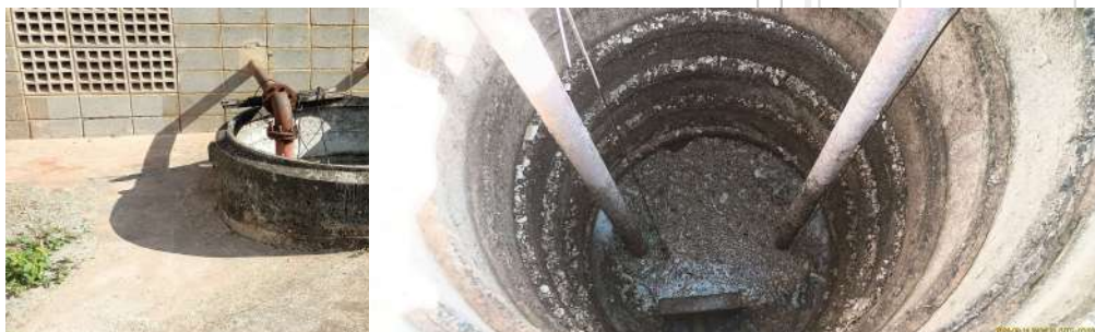
Foto 5 - Poço de sucção da EEE.
