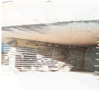
Foto 7 - Canal de gradeamento do esgoto.
