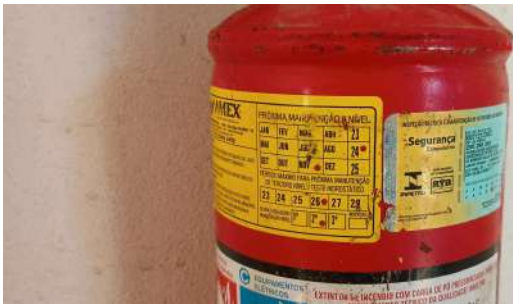
Foto 1 - Validade do extintor de incêndio.
