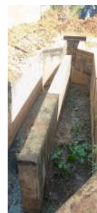
Foto 8 - Canal desarenador da EEE.
