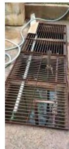
Foto 2 - Poço de sucção, com apenas uma bomba instalada (apenas uma corrente de sustentação presente).
