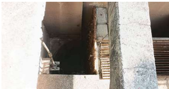
Foto 5 - Canal de chegada e gradeamento do esgoto.
