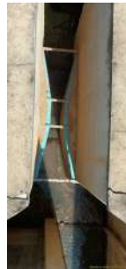
Foto 9 - Calha parshall da EEE.
