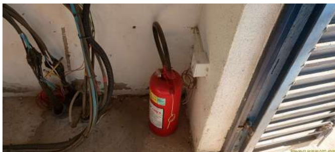
Foto 1 - Extintor de incêndio do local.
