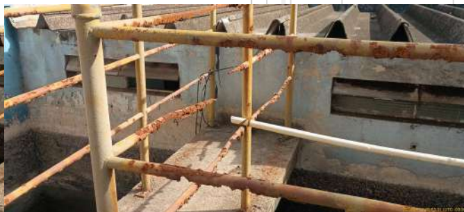
Foto 2 - Situação dos guarda-corpo dos tanques de sucção.
