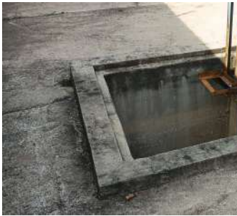
Foto 1 - Poço de chegada do esgoto, sem delimitações ou proteção em seu entorno.
