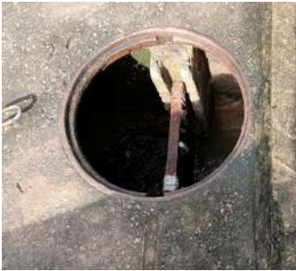
Foto 5 - Poços de chegada e gradeamento da EEE.
