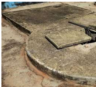
Foto 6 - Poço de sucção com motobombas submersas.
