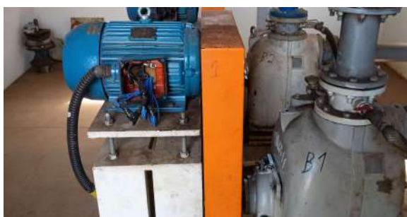
Foto 11 - Primeiro conjunto motobomba (B1).
