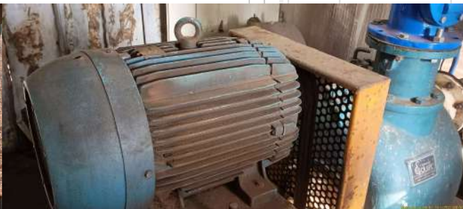
Foto 13 - Motor de um dos conjuntos motobomba.
