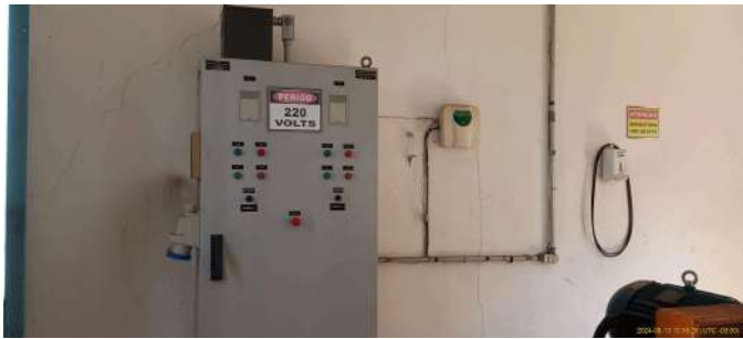
Foto 17 - Paineleletrico e de comando da EEE.
