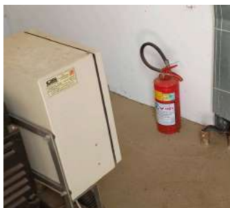
Foto 9 - Extintor de incêndio da EEE.
