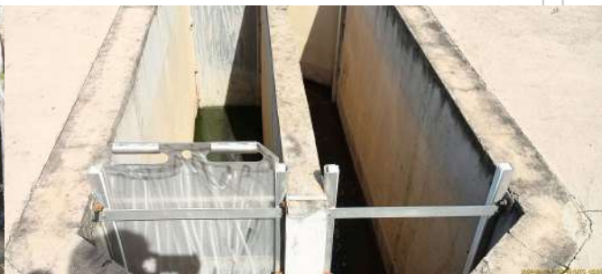
Foto 8 - Canais desarenador da EEE.
