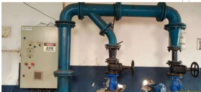
Foto 9 - Tubulação de recalque da EEE.
