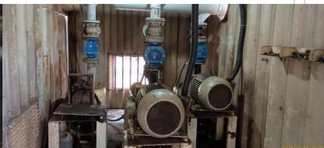
Foto 9 - Conjuntos motobomba instalados na EEE: B1 (esquerda e sem motor), B2 (centro) e B3 (direita).
