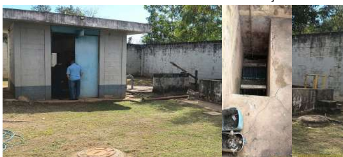
Foto 3 - Vista geral interna da EEE.
