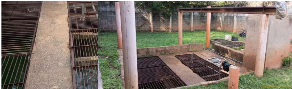
Foto 9 - Poço de sucção, onde se encontra a bomba submersa.
