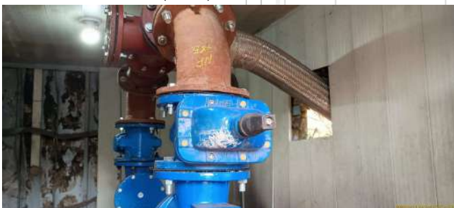
Foto 11 - Barrilete das tubulações de saída da EEE.
