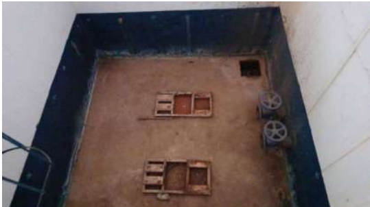
Foto 3 - Vista interna da EEE (Fonte: DAE, 2024).
