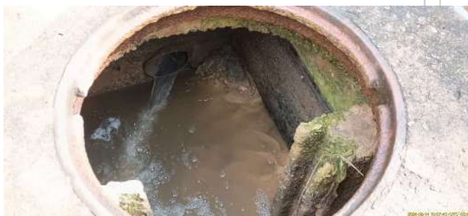
Foto 3 - Detalhe da deposição de sedimentos próximo ao gradeamento.
