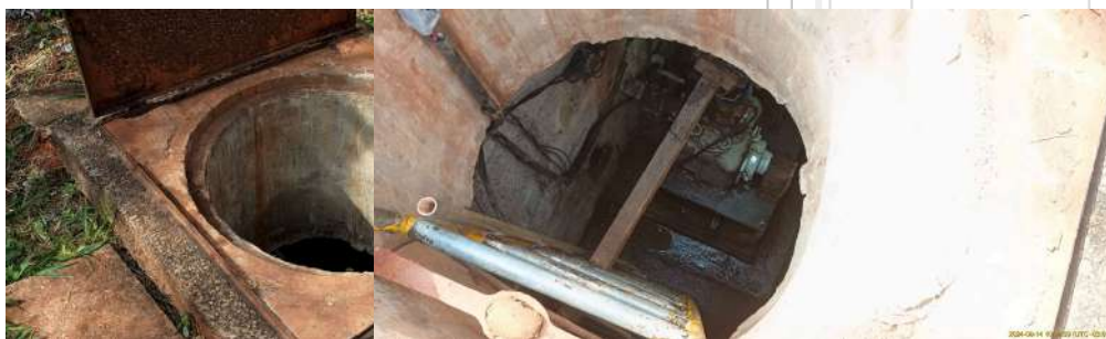
Foto 7 - Poço seco dos Foto 8 - Poço seco dos conjuntos motobomba. conjuntos motobomba.
