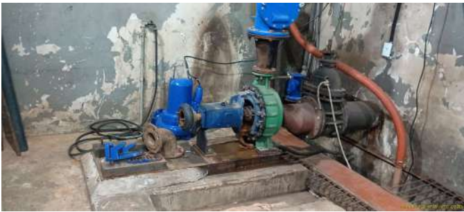
Foto 18 - Ausência do terceiro conjunto motobomba.
