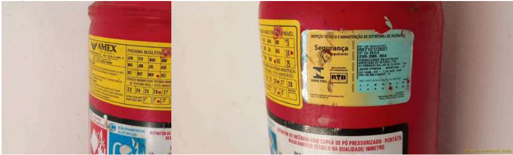
Foto 1 - Validade do extintor de incêndio. Foto 2 - Validade do extintor de incêndio.
