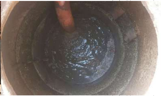
Foto 10 - Poço de sucção (Fonte: DAE Americana, 30/08/2024).
