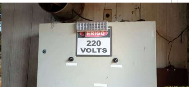
Foto 8 - Painel elétrico e de comando.
