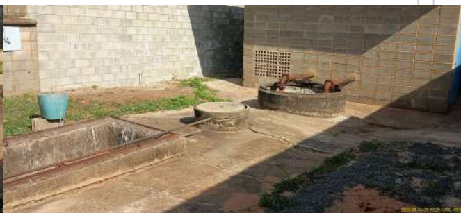
Foto 2 - Ausência de tampa ou grade ou outra estrutura de proteção na parte superior do poço de sucção.
