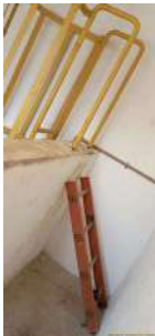
Foto 9 - Acesso para o poço (seco) dos conjuntos motobomba.
