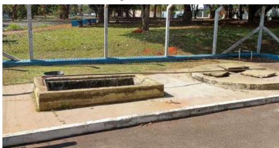
Foto 3 - Poço para acesso ao gradeamento grosseiro e limpeza do material retido e, à direita, poço de sucção onde estão as bombas submersas.
