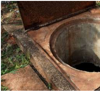
Foto 7 - Poço seco dos conjuntos motobomba.
