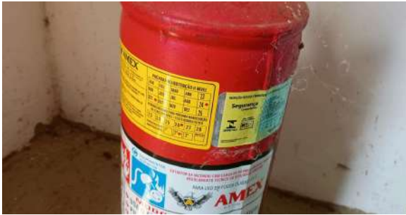
Foto 1 - Validade do extintor dentro do prazo regular.
