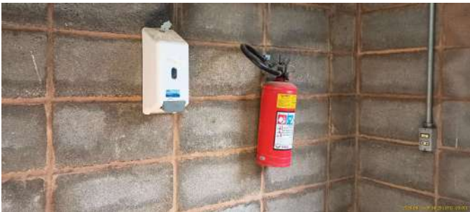
Foto 1 - Extintor de incêndio instalado na EEE.
