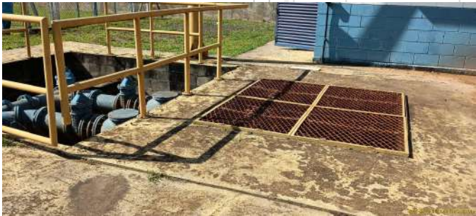
Foto 9 - Poço de sucção, onde se encontram as motobombas submersas e, ao lado, barrilete de recalque do esgoto.
