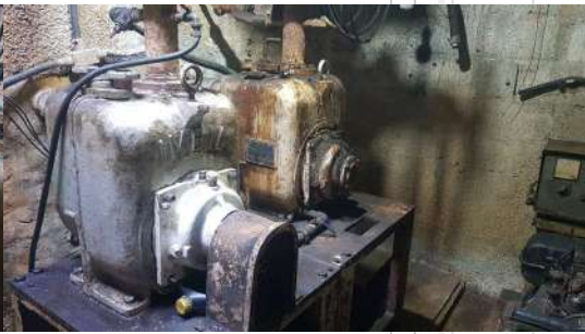
Foto 12 - Conjuntos girantes da EEE (apenas um está acoplado a motor elétrico). (Fonte: DAE Americana, 30/08/2024).
