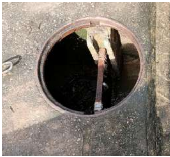
Foto 5 - Poços de chegada e gradeamento da EEE.
