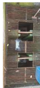
Foto 4 - Vista das grades e ancinho de limpeza do material retido
