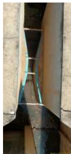
Foto 9 - Calha parshall da EEE.
