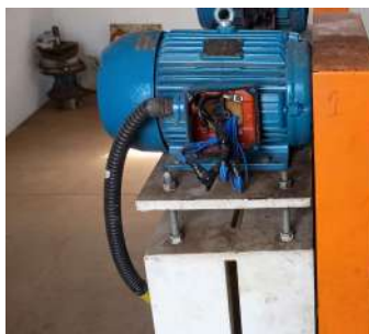
Foto 11 - Primeiro conjunto motobomba (B1).
