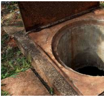
Foto 7 - Poço seco dos conjuntos motobomba.
