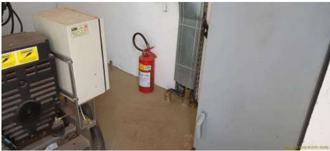
Foto 1 - Extintor de incêndio do local.
