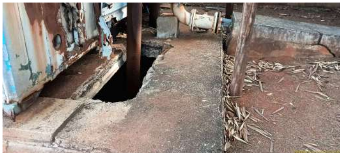
Foto 1 - Situação do poço de sucção da EEE.
