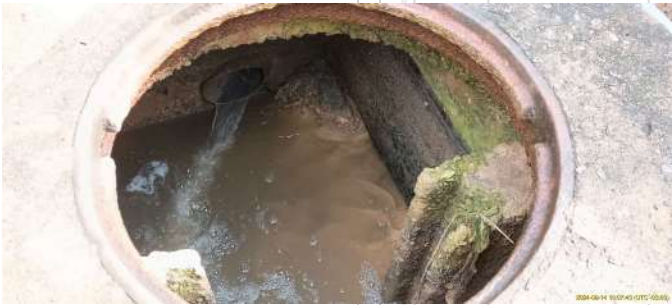
Foto 3 - Detalhe da deposição de sedimentos próximo ao gradeamento.
