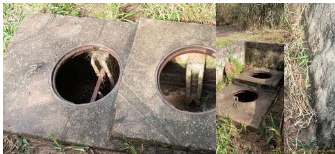
Foto 3 - Poços de chegada e gradeamento da EEE.
