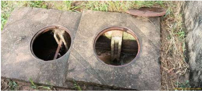
Foto 3 - Poços de chegada e gradeamento da EEE.
