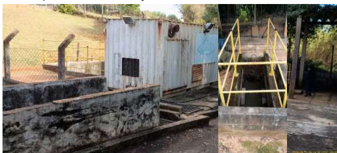
Foto 3 - Abrigo dos conjuntos motobomba.
