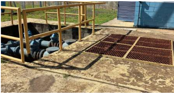
Foto 9 - Poço de sucção, onde se encontram as motobombas submersas e, ao lado, barrilete de recalque do esgoto.
