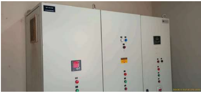
Foto 11 - Painele elétricos e de comando da EEE.
