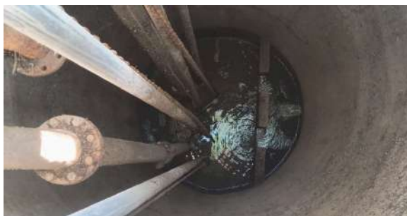
Foto 8 - Poço de sucção, com motobombas submersas.
