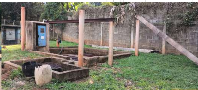
Foto 4 - Vista geral interna da EEE.
