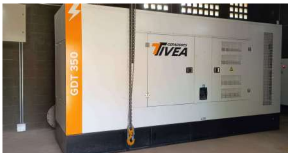
Foto 5 - Gerador de energia elétrica a diesel.
