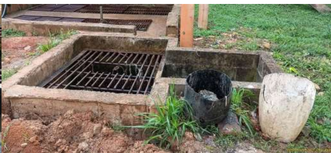
Foto 6 - Local de chegada do esgoto e gradeamento. Tambores utilizados para transporte do material retido nas grades.
