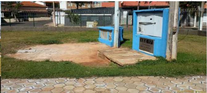
Foto 4 - Antiga EEE 17 situada dentro da área da nova EEE.
