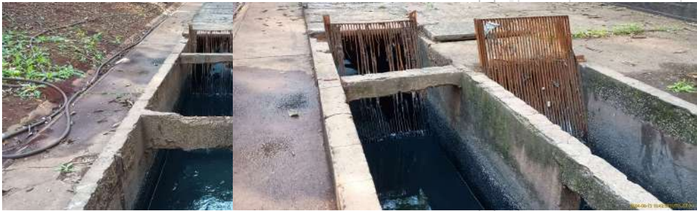
Foto 1 - Situação das grades da EEE. Foto 2 - Situação das grades da EEE.
