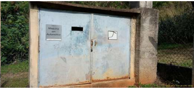
Foto 6 - Abrigo do painel elétrico e de comando da EEE.
