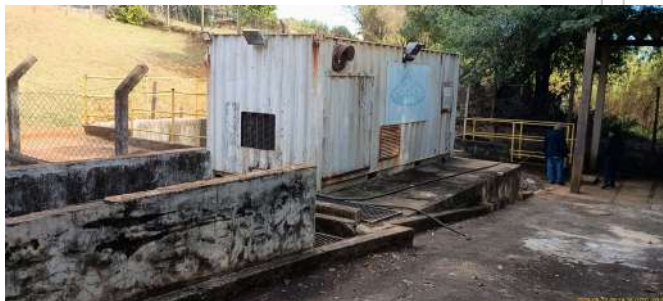
Foto 3 - Abrigo dos conjuntos motobomba.
