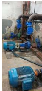
Foto 14 - Conjuntos motobomba da EEE.
