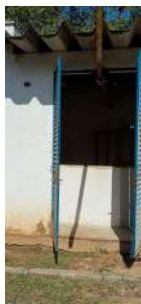
Foto 5 - Abrigo e acesso para os conjuntos motobomba (poço seco).
