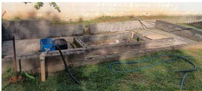
Foto 3 - Canal de chegada do esgoto e gradeamento.
