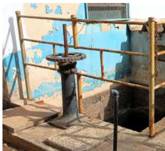
Foto 1 - Situação dos guarda-corpo dos tanques de sucção.
