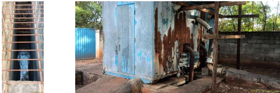
Foto 5 - Canal de chegada do esgoto. Foto 6 - Abrigo das máquinas e do painel elétrico e de comando.
