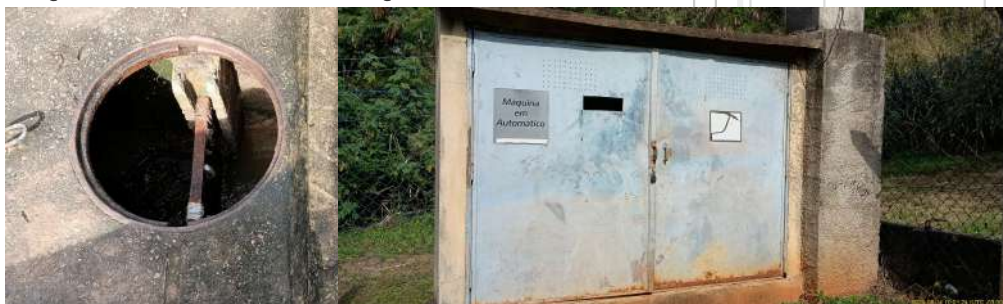
Foto 5 - Poços de chegada e gradeamento da EEE.
