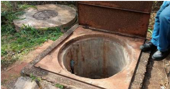
Foto 9 - Poço seco dos conjuntos motobomba.
