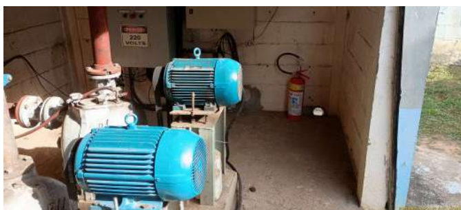
Foto 16 - Conjuntos motobomba da EEE.
