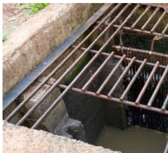
Foto 7 - Local de chegada do esgoto e gradeamento.
