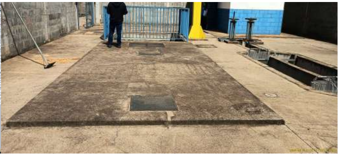
Foto 14 - Tampa do poço de sucção da EEE (fechado no momento da fiscalização).
