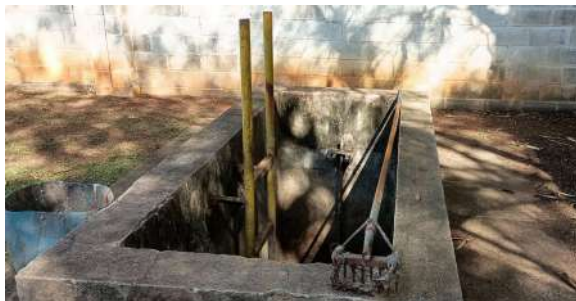
Foto 6 - Poço de gradeamento grosseiro, com uso de ancinho.
