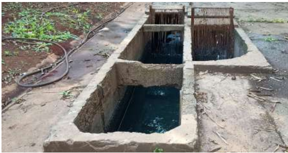
Foto 1 - Ausência de guarda-corpo no entorno do canal de chegada do esgoto e gradeamento ou de tampas/grades horizontais, impedindo quedas e acidentes.
