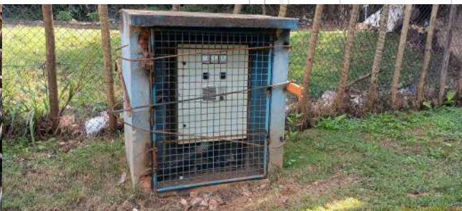
Foto 8 - Painel elétrico e de comando, com diversas estruturas de proteção contra furtos.
