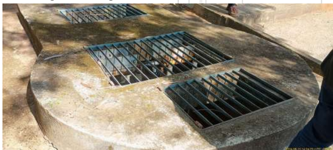
Foto 7 - Poço de sucção, com motobombas submersas.
