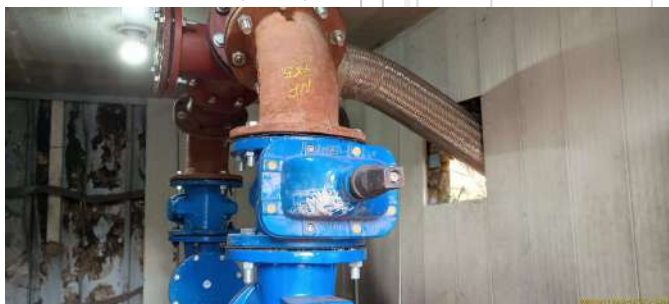
Foto 11 - Barrilete das tubulações de saída da EEE.
