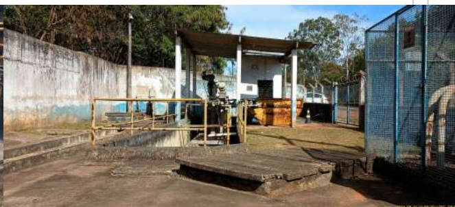
Foto 10 - Equipamento antigo de limpeza preliminar do esgoto antes do bombeamento. Porém está desativado.
