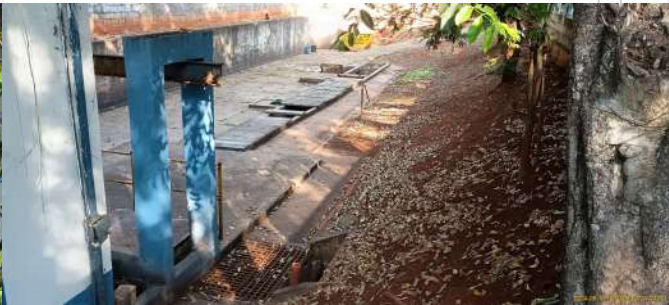
Foto 4 - Vista do piso inferior da EEE.
