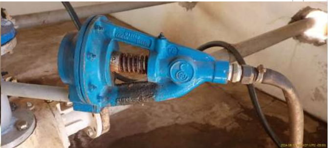
Foto 2 - Detalhe do vazamento na mola.
