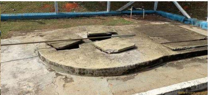
Foto 2 - Fechamento inadequado dos vãos acima do poço de sucção.
