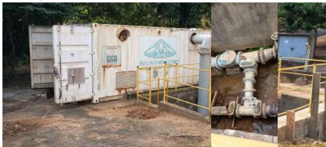
Foto 5 - Abrigo dos conjuntos motobomba.
