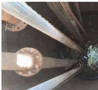
Foto 8 - Poço de sucção, com motobombas submersas.
