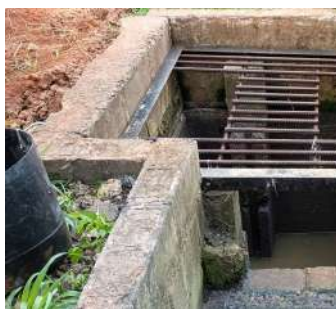
Foto 5 - Local de chegada do esgoto e gradeamento.
