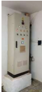
Foto 10 - Painel elétrico da EEE.
