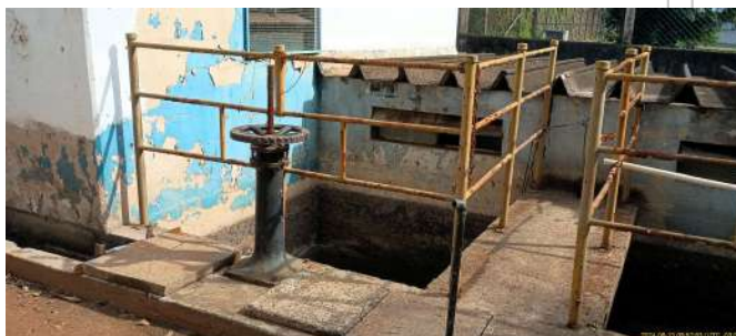
Foto 8 - Tanques de distribuição do esgoto após gradeamento, direcionando individualmente para cada conjunto motobomba.
