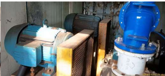
Foto 10 - Conjuntos motobomba da EEE (1+1R).
