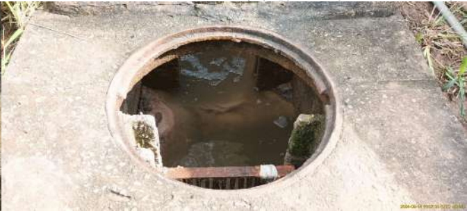
Foto 2 - Detalhe da deposição de sedimentos próximo ao gradeamento.
