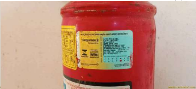
Foto 2 - Validade do extintor de incêndio.
