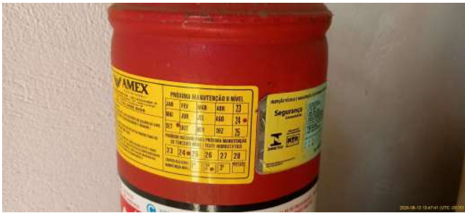
Foto 1 - Valida regular do extintor de incêndios.
