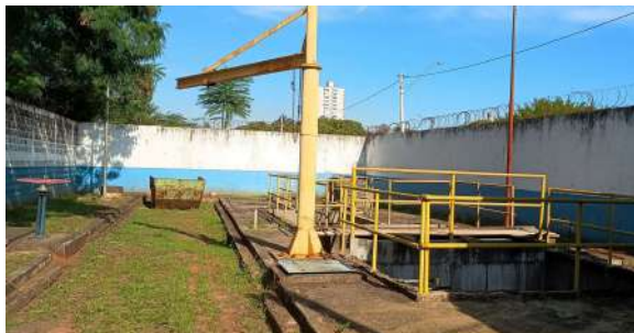
Foto 3 - Vista geral interna da EEE.
