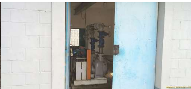
Foto 10 - Vista interna do abrigo dos conjuntos motobomba.
