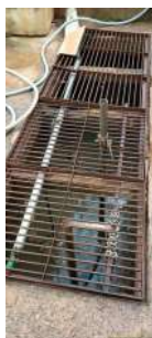
Foto 11 - Poço de sucção, onde se encontra a bomba submersa.
