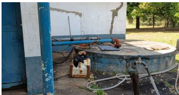
Foto 5 - Poço de sucção da EEE.
