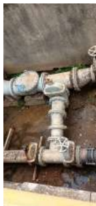
Foto 6 - Barrilete da tubulação de recalque do esgoto.
