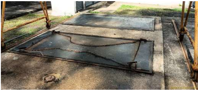
Foto 9 - Tampas do poço de sucção, onde ficam as bombas submersas.
