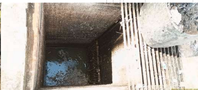
Foto 8 - Poço de chegada do esgoto e gradeamento.
