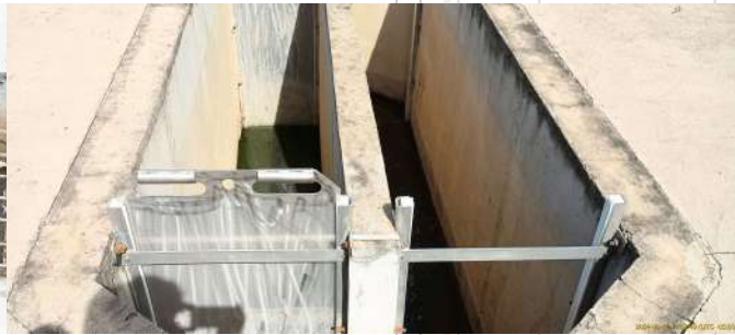
Foto 8 - Canais desarenador da EEE.
