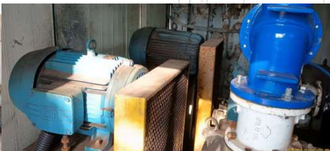
Foto 10 - Conjuntos motobomba da EEE (1+1R).
