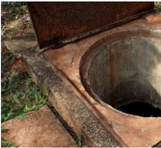
Foto 7 - Poço seco dos conjuntos motobomba.
