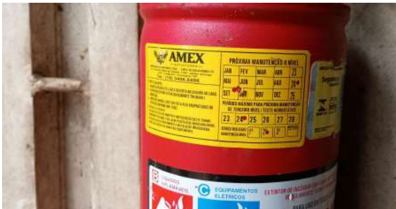
Foto 1 - Validade do extintor dentro do prazo adequado.
