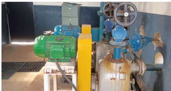
Foto 7 - Vista dos conjuntos motobomba ainda instalados na EEE.
