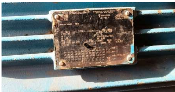
Foto 13 - Placa de especificações técnicas do primeiro conjunto motobomba.
