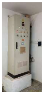
Foto 10 - Painel elétrico da EEE.
