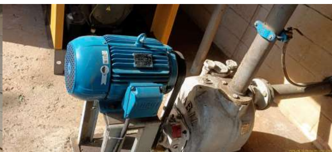
Foto 12 - Primeiro conjunto motobomba.
