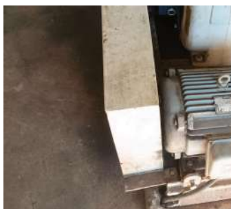
Foto 8 - Motor do primeiro conjunto motobomba.
