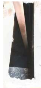
Foto 2 - Abertura na cobertura do poço de sucção.
