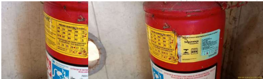
Foto 1 - Validade do extintor dentro do prazo regular. Foto 2 - Validade do extintor dentro do prazo regular.
