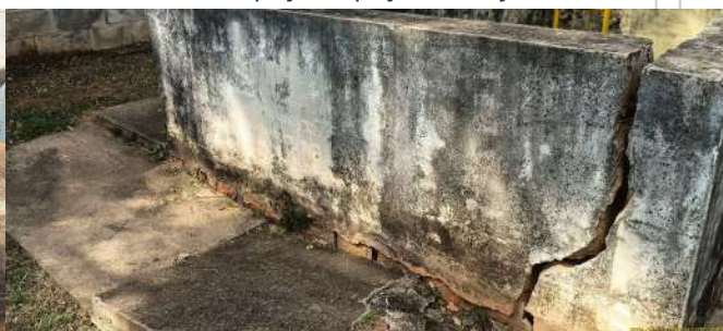
Foto 4 - Rachadura na mureta no entorno do poço de acesso ao gradeamento.
