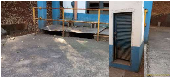
Foto 3 - Guarda-corpo no entorno das tampas do poço de sucção em avançado estado de corrosão.
