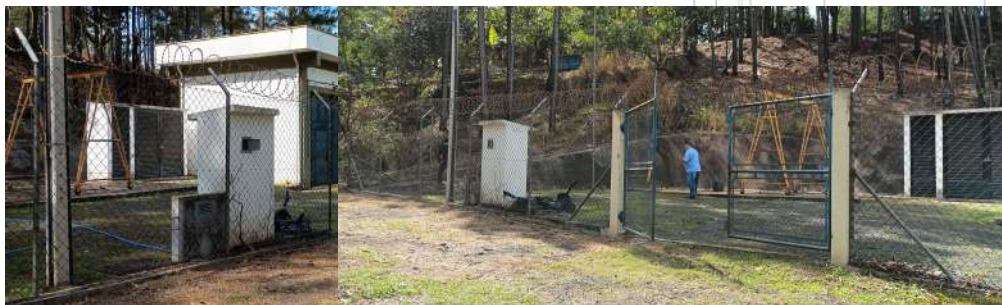
Foto 1 - Vista geral da EEE.
