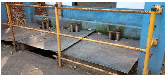
Foto 1 - Apenas um conjunto instalado (apenas uma corrente de sustentação).
