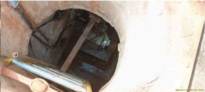
Foto 8 - Poço seco dos conjuntos motobomba.
