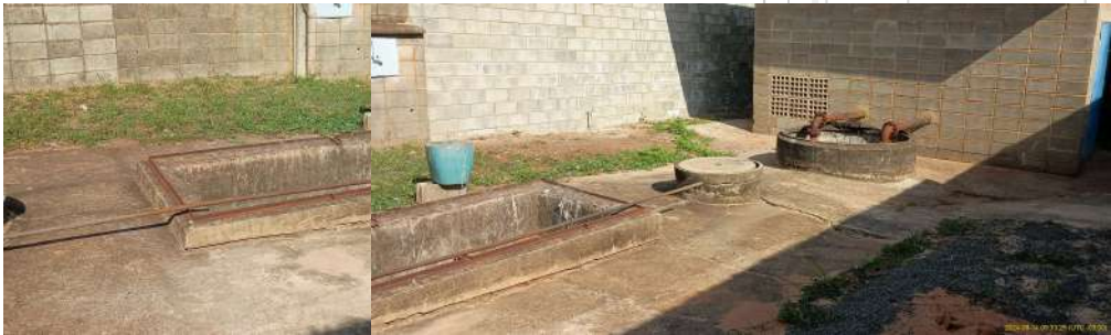
Foto 1 - Ausência de tampa ou grade ou outra estrutura de proteção na abertura do canal.
