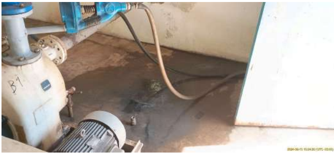
Foto 3 - Detalhe do piso molhado no entorno do primeiro conjunto motobomba.
