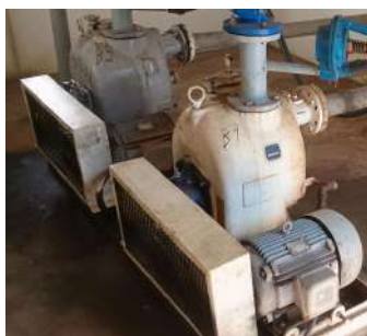
Foto 1 - Detalhe do piso molhado no entorno do primeiro conjunto motobomba.
