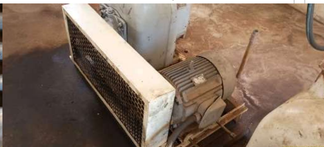
Foto 10 - Motor do segundo conjunto motobomba.
