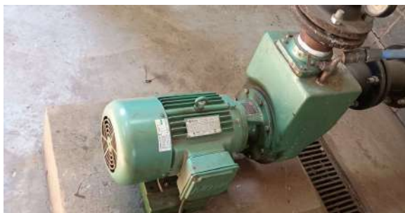
Foto 9 - Primeiro conjunto motobomba da EEE.
