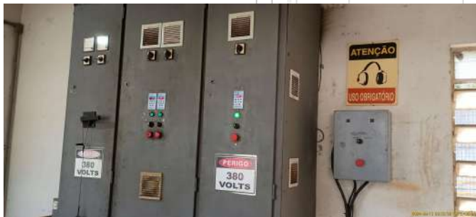
Foto 13 - Paineleletrico e de comando da EEE.
