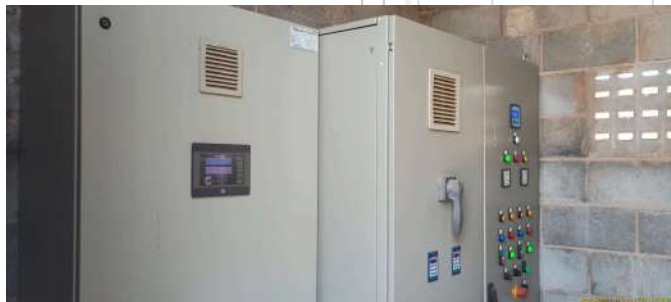
Foto 11 - Painel elétrico e de comando da EEE.
