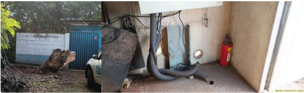
Foto 7 - Vista externa da EEE. Foto 8 - Extintor de incêndio no piso, dentro da EEE.
