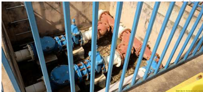
Foto 10 - Barrilete da EEE.
