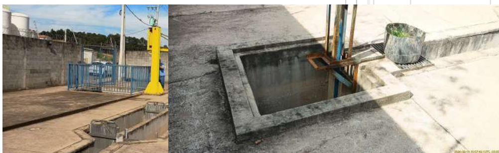
Foto 3 - Vista geral interna da EEE.
