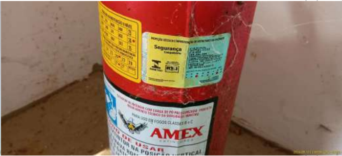
Foto 2 - Validade do extintor dentro do prazo regular.
