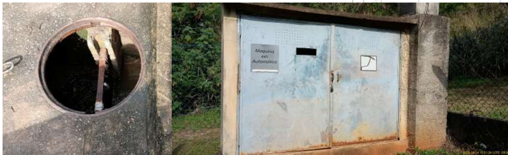
Foto 5 - Poços de chegada e Foto 6 - Abrigo do painel gradeamento da EEE. elétrico e de comando da EEE.
