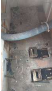
Foto 3 - Vista interna da EEE, sem motobombas. (Fonte: DAE, 2024)
