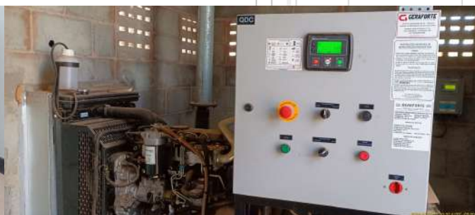
Foto 13 - Painel elétrico e de comando do gerador de energia a diesel.
