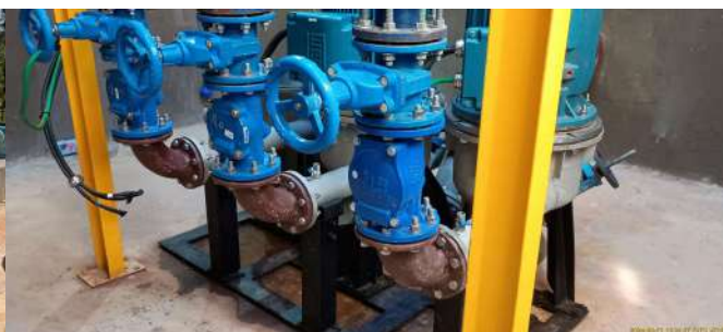
Foto 10 - Três conjuntos motobomba da EEE.
