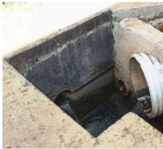
Foto 6 - Tubulações de chegada do esgoto na EEE.
