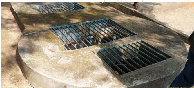
Foto 7 - Poço de sucção, com motobombas submersas.
