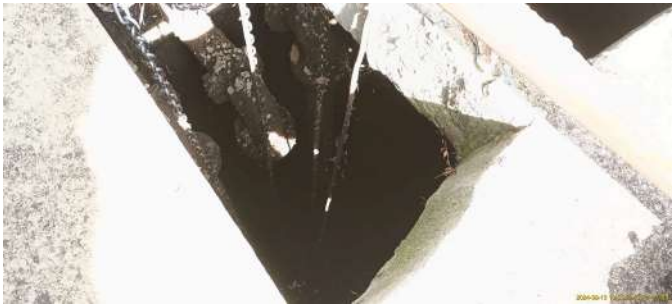
Foto 12 - Vão com correntes de sustentação das bombas submersas instaladas.
