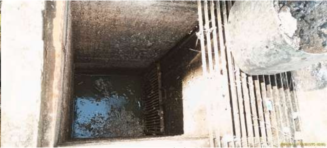
Foto 8 - Poço de chegada do esgoto e gradeamento.
