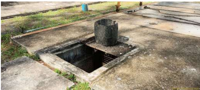
Foto 1 - Ausência de tampa ou grade no poço de gradeamento.
