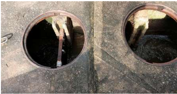
Foto 5 - Poços de chegada e gradeamento da EEE.
