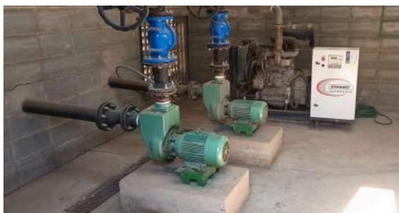
Foto 7 - Conjuntos motobomba da EEE.
