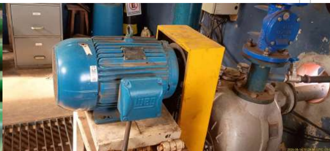
Foto 11 - Segundo conjunto motobomba da EEE.
