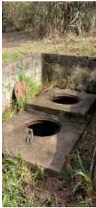
Foto 4 - Poços de chegada e gradeamento da EEE.
