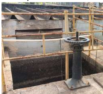
Foto 9 - Tanques de distribuição do esgoto após gradeamento, direcionando individualmente para cada conjunto motobomba.
