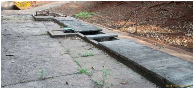
Foto 6 - Vista do canal de chegada do esgoto e gradeamento.
