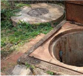
Foto 9 - Poço seco dos conjuntos motobomba.
