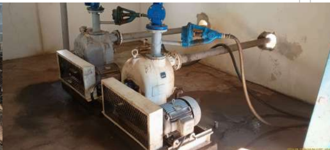
Foto 7 - Conjuntos motobomba (1+1R) da EEE.
