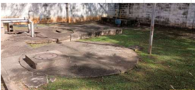
Foto 14 - Reservatório de acúmulo (tanque pulmão) ao lado do poço de sucção.
