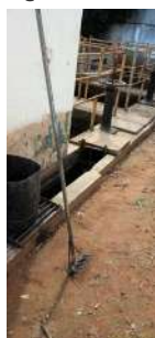
Foto 7 - Tanques de distribuição do esgoto após gradeamento, direcionando individualmente para cada conjunto motobomba.
