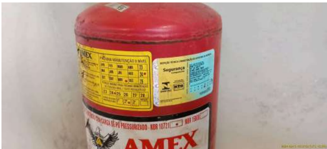
Foto 1 - Validade do extintor com prazo adequado.
