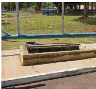
Foto 3 - Poço para acesso ao gradeamento grosseiro e limpeza do material retido e, à direita, poço de sucção onde estão as bombas submersas.
