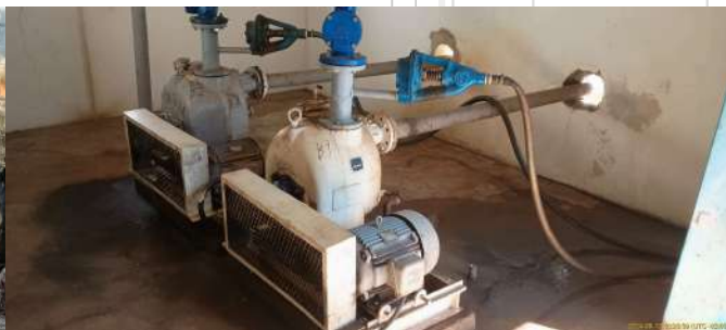
Foto 7 - Conjuntos motobomba (1+1R) da EEE.
