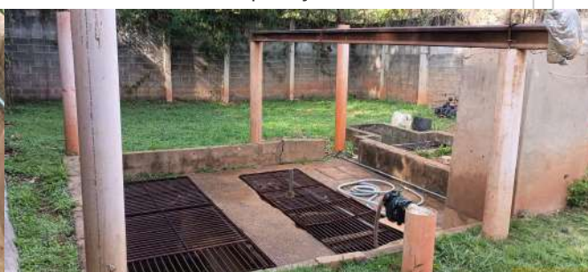
Foto 10 - Vista geral da EEE.
