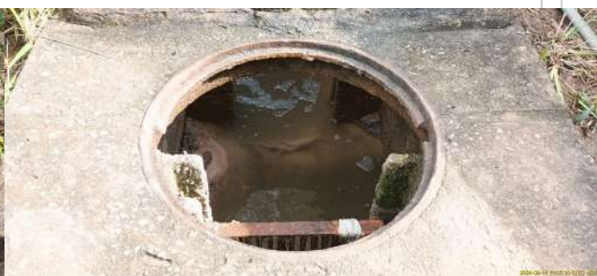
Foto 2 - Detalhe da deposição de sedimentos próximo ao gradeamento.
