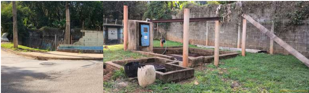
Foto 3 - Vista geral externa da EEE. Foto 4 - Vista geral interna da EEE.
