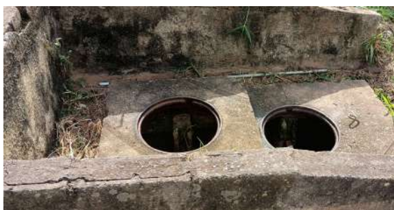
Foto 1 - Ausência de tampas ou grades para fechar as aberturas do local de gradeamento quando não estiver ocorrendo a limpeza do material retido.
