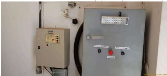
Foto 8 - Painéis elétricos e de comando da EEE.
