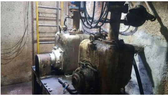
Foto 11 - Conjuntos girantes da EEE (apenas um está acoplado a motor elétrico). (Fonte: DAE Americana, 30/08/2024).
