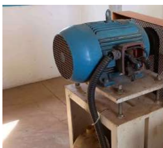
Foto 13 - Segundo conjunto motobomba (B2).
