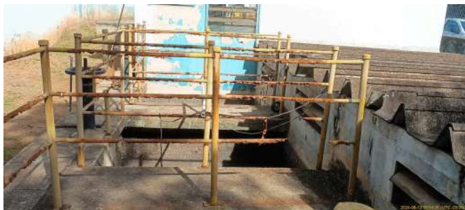
Foto 7 - Situação dos guarda-corpo dos tanques de sucção.
