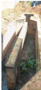
Foto 8 - Canal desarenador da EEE.
