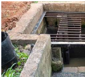
Foto 5 - Local de chegada do esgoto e gradeamento.
