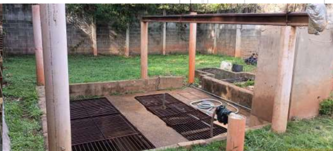
Foto 10 - Vista geral da EEE.
