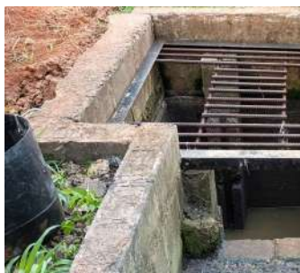
Foto 5 - Local de chegada do esgoto e gradeamento.
