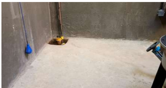
Foto 13 - Bomba para remoção de água no interior do poço seco.
