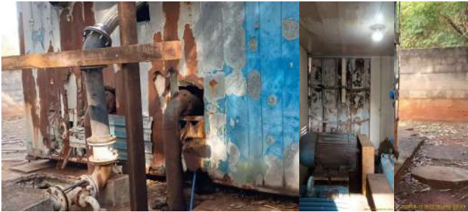
Foto 3 - Tubulações de sucção.
