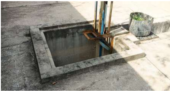
Foto 1 - Poço de chegada do esgoto, sem delimitações ou proteção em seu entorno.
