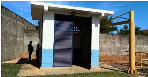
Foto 3 - Vista do abrigo do gerador de energia elétrica a diesel
