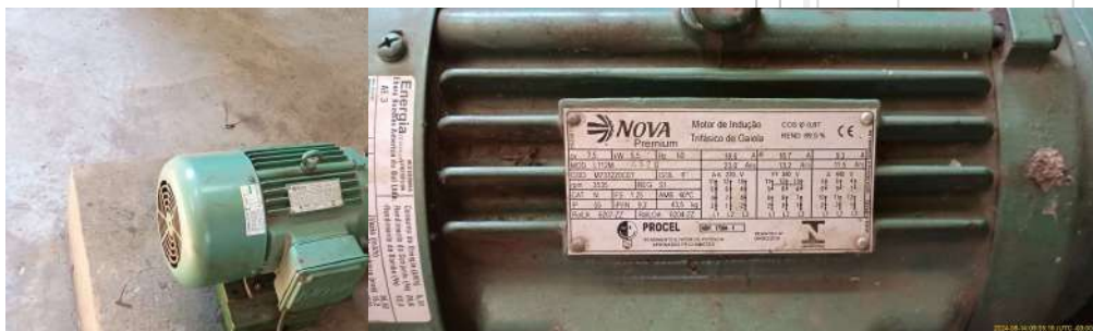
Foto 9 - Primeiro conjunto motobomba da EEE.
