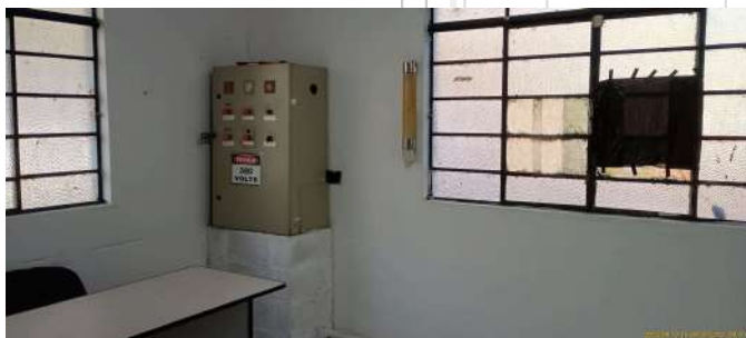
Foto 9 - Painel elétrico da EEE.
