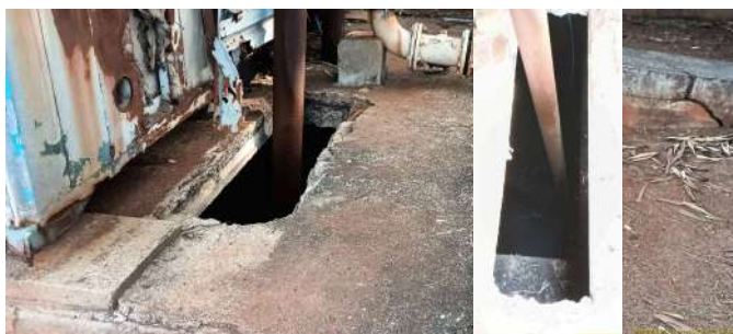
Foto 1 - Situação do poço de sucção da EEE.
