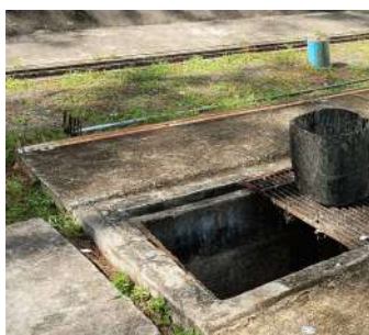
Foto 7 - Poço de chegada do esgoto e gradeamento.
