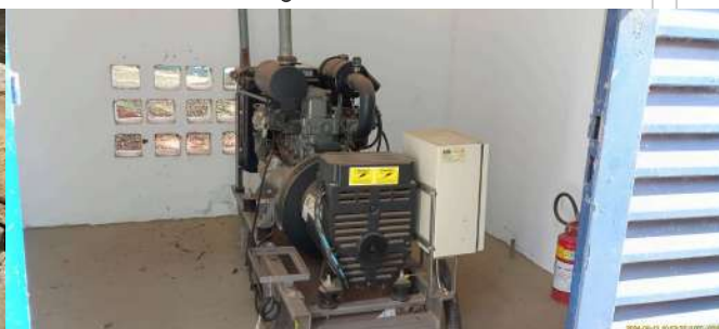
Foto 7 - Gerador de energia a diesel.
