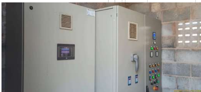
Foto 11 - Painel elétrico e de comando da EEE.
