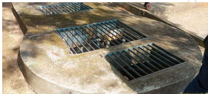
Foto 7 - Poço de sucção, com motobombas submersas.
