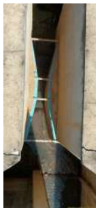
Foto 9 - Calha parshall da EEE.
