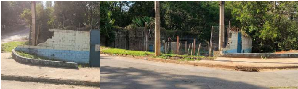
Foto 1 - Vista geral da entrada da EEE. Foto 2 - Vista geral externa da EEE.
