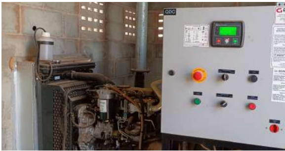
Foto 13 - Painel elétrico e de comando do gerador de energia a diesel.
