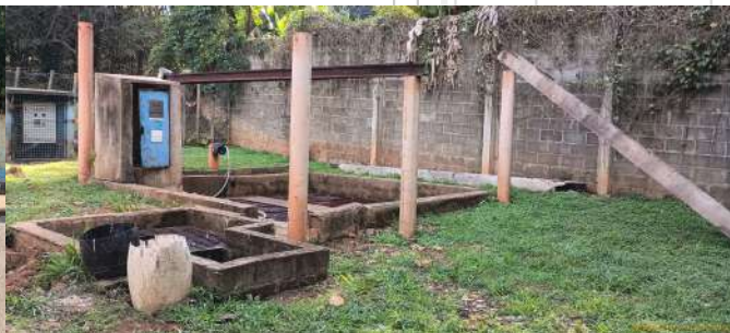
Foto 4 - Vista geral interna da EEE.
