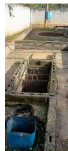
Foto 4 - Canal de chegada do esgoto e gradeamento.
