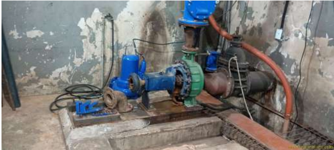
Foto 18 - Ausência do terceiro conjunto motobomba.
