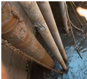
Foto 10 - Vista interna do poço de sucção com motobombas submersas.
