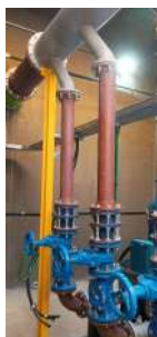
Foto 11 - Barrilete dos conjuntos motobomba da EEE.
