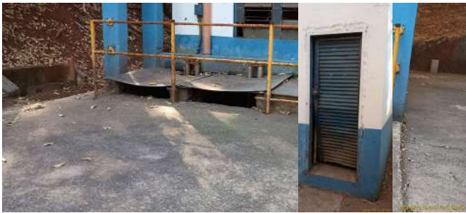
Foto 3 - Guarda-corpo no entorno das tampas do poço de sucção em avançado estado de corrosão. Foto 4 - Porta danificada na parte inferior.
