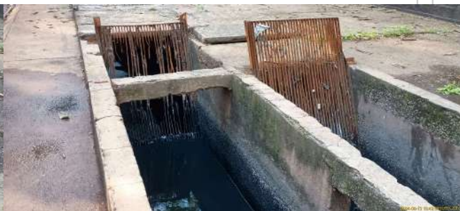
Foto 2 - Situação das grades da EEE.
