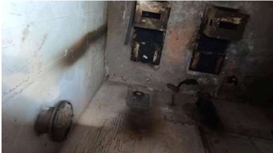
Foto 4 - Vista interna da EEE, sem motobombas. (Fonte: DAE, 2024)
