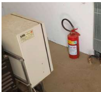
Foto 9 - Extintor de incêndio
