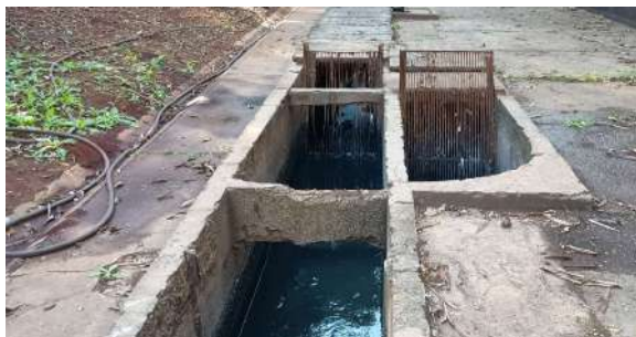
Foto 1 - Situação das grades da EEE.
