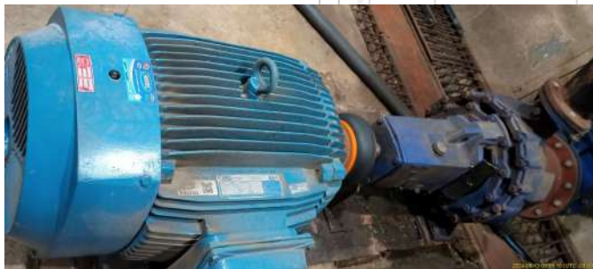
Foto 15 - Primeiro conjunto motobomba.
