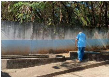
Foto 4 - Vista geral interna da EEE.
