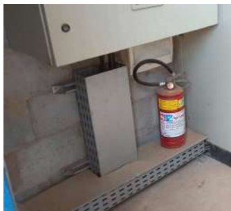
Foto 12 - Extintor de incêndio da EEE próximo aos painéis elétricos.
