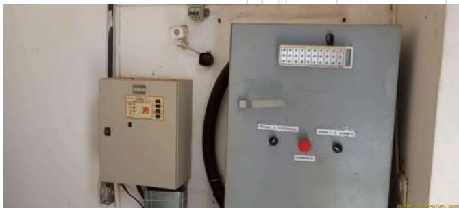
Foto 8 - Painéis elétricos e de comando da EEE.
