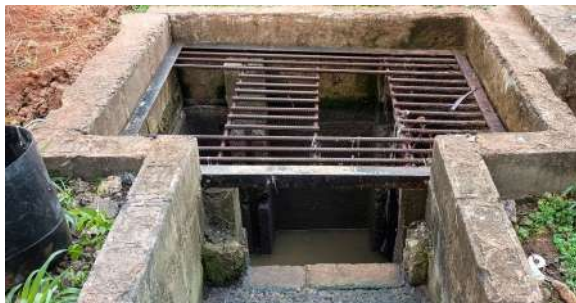
Foto 5 - Local de chegada do esgoto e gradeamento.
