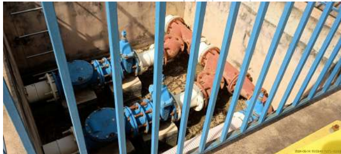
Foto 10 - Barrilete da EEE.
