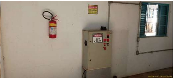
Foto 13 - Extintor de incêndio do local.
