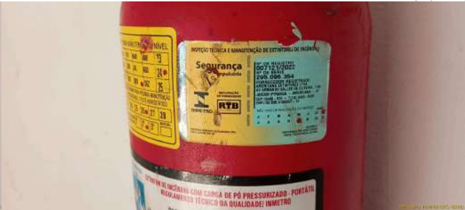
Foto 2 - Validade do extintor de incêndio.
