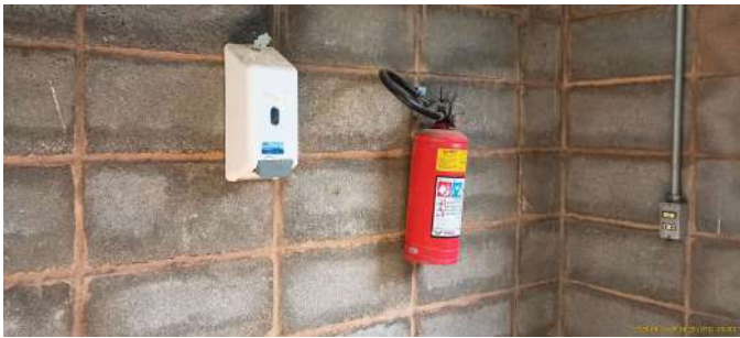
Foto 1 - Extintor de incêndio instalado na EEE.
