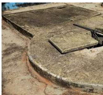
Foto 6 - Poço de sucção com motobombas submersas.
