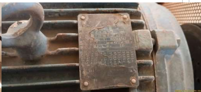
Foto 14 - Placa de especificações técnicas do motor do segundo conjunto motobomba (B2).
