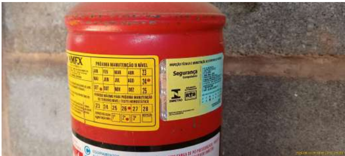
Foto 1 - Validade do extintor de incêndio dentro do prazo regular.
