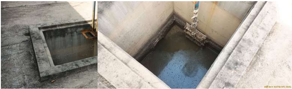
Foto 1 - Poço de chegada do esgoto, sem delimitações ou proteção em seu entorno.
