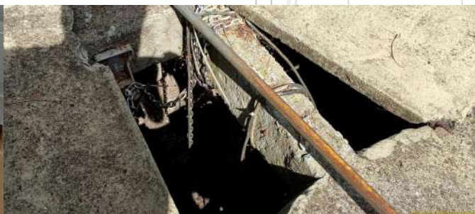
Foto 10 - Vão com correntes de sustentação das bombas
