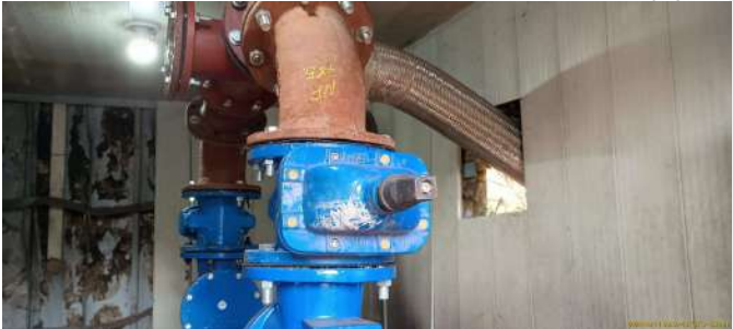
Foto 11 - Barrilete das tubulações de saída da EEE.
