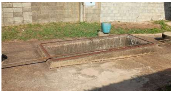
Foto 1 - Ausência de tampa ou grade ou outra estrutura de proteção na abertura do canal.
