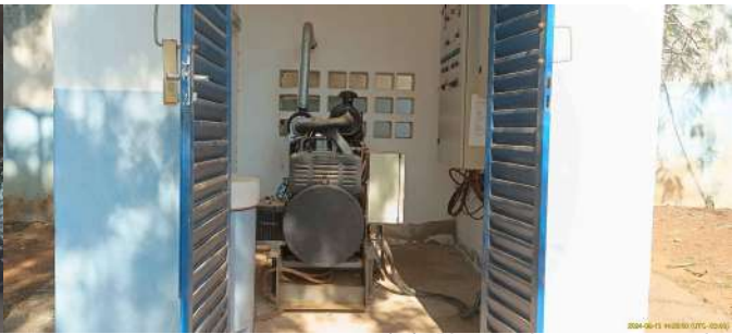
Foto 9 - Abrigo do gerador de energia elétrica a diesel.
