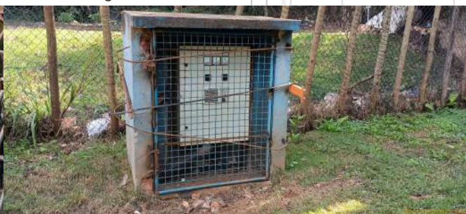
Foto 8 - Pannel elétrico e de comando, com diversas estruturas de proteção contra furtos.
