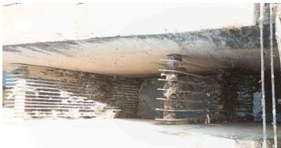
Foto 7 - Canal de gradeamento do esgoto.
