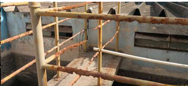
Foto 2 - Situação dos guarda-corpo dos tanques de sucção.
