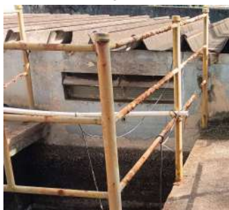
Foto 3 - Situação dos guarda-corpo dos tanques de sucção.
