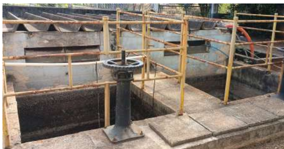
Foto 9 - Tanques de distribuição do esgoto após gradeamento, direcionando individualmente para cada conjunto motobomba.
