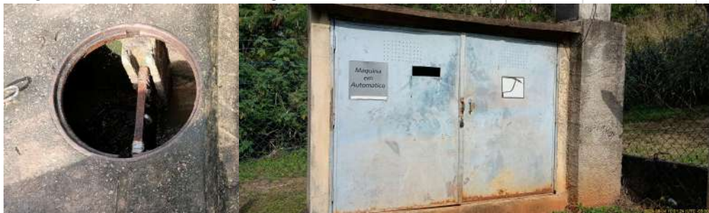
Foto 5 - Poços de chegada e gradeamento da EEE.
