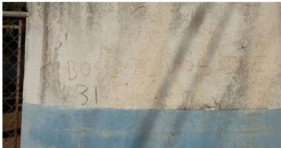
Foto 1 - Nome da EEE escrito de maneira inadequada na muro externo.
