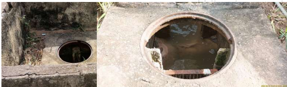
Foto 1 - Ausência de tampas ou grades para fechar as
