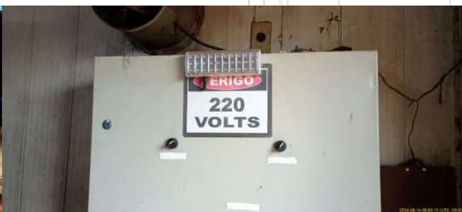
Foto 8 - Painel elétrico e de comando.
