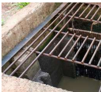
Foto 7 - Local de chegada do esgoto e gradeamento.
