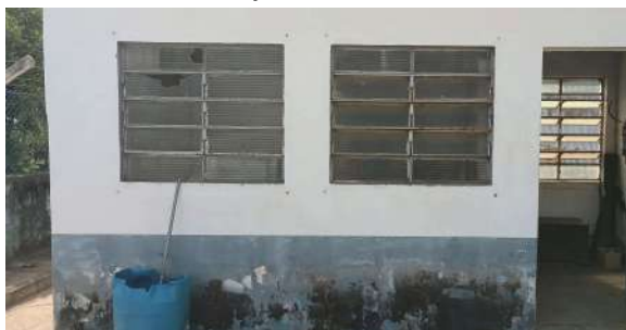
Foto 11 - Entrada do abrigo dos conjuntos motobomba e painéis elétricos.
