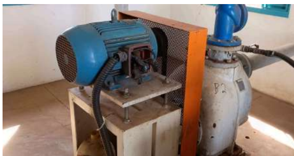
Foto 13 - Segundo conjunto motobomba (B2).
