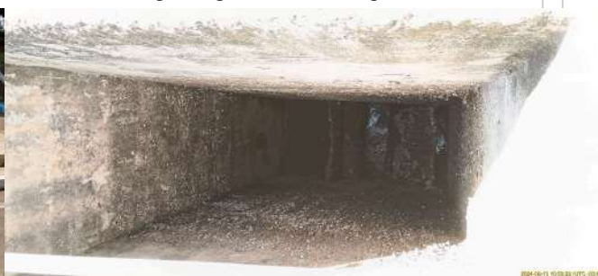
Foto 4 - Vista interna do gradeamento grosseiro.
