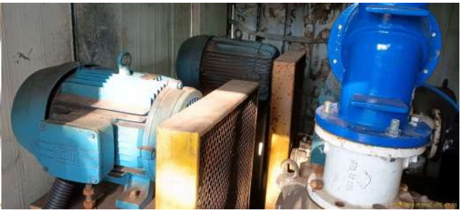
Foto 10 - Conjuntos motobomba da EEE (1+1R).
