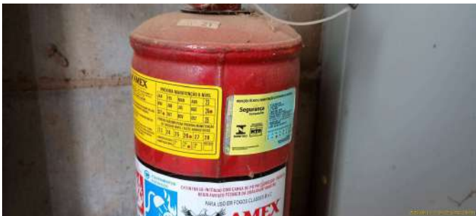
Foto 1 - Validade do extintor dentro do prazo regular.
