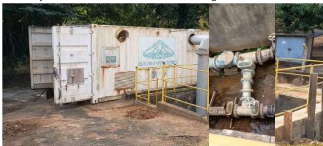
Foto 5 - Abrigo dos conjuntos motobomba.
