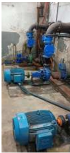
Foto 14 - Conjuntos motobomba da EEE.
