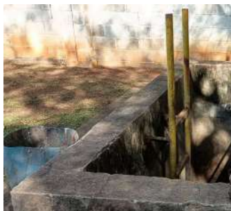
Foto 6 - Poço de gradeamento grosseiro, com uso de ancinho.
