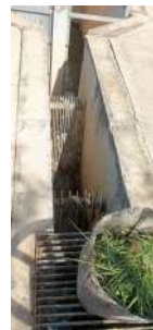
Foto 6 - Canal de gradeamento do esgoto.
