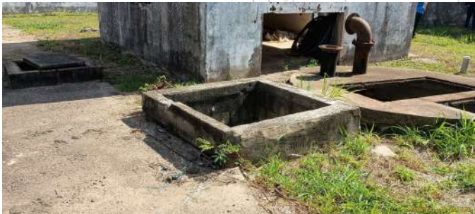
Foto 2 - Poço de sucção e caixa de registros da tubulação.
