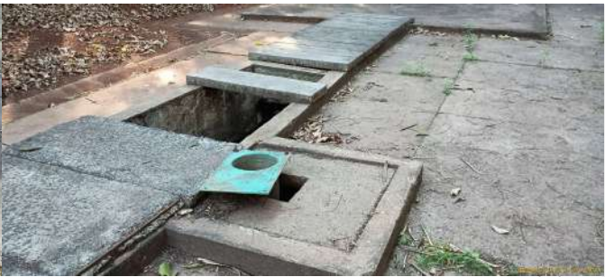
Foto 2 - Ausência de guarda-corpo no entorno do canal entre o gradeamento e o poço de sucção de tampas/grades horizontais, impedindo quedas e acidentes.
