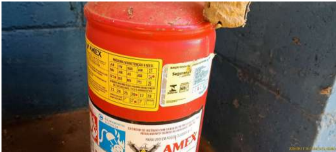
Foto 1 - Validade do extintor com prazo adequado.
