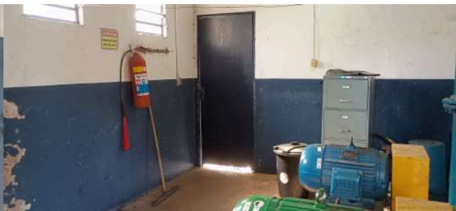
Foto 8 - Vista interna da casa de bombas da EEE.
