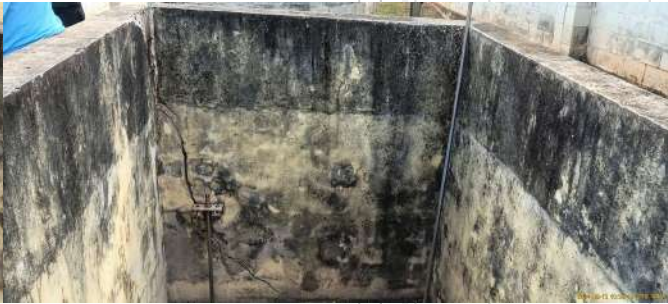
Foto 6 - Rachadura na mureta no entorno do poço de acesso ao gradeamento.
