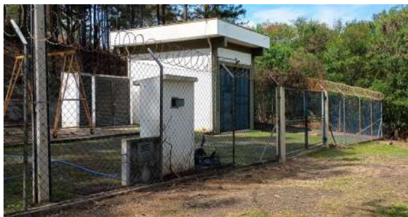
Foto 1 - Vista geral da EEE.
