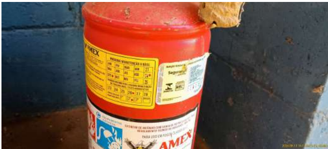
Foto 1 - Validade do extintor com prazo adequado.
