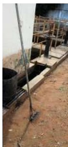
Foto 7 - Tanques de distribuição do esgoto após gradeamento, direcionando individualmente para cada conjunto motobomba.
