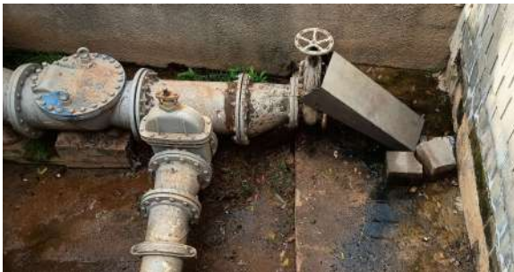
Foto 1 - Vazamento no barrilete de recalque.
