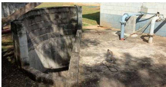
Foto 3 - Ausência de guarda-corpo ou grade horizontal no espaço do poço de sucção.
