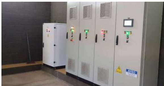
Foto 7 - Painel elétrico e de comando da EEE.
