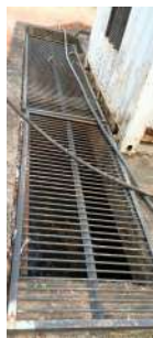
Foto 14 - Grade horizontal de proteção do poço de sucção do esgoto.
