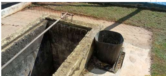
Foto 5 - Ancinho e tambor de remoção do material retido no gradeamento.
