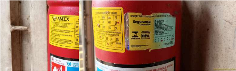
Foto 1 - Validade do extintor dentro do prazo adequado. Foto 2 - Validade do extintor dentro do prazo adequado.
