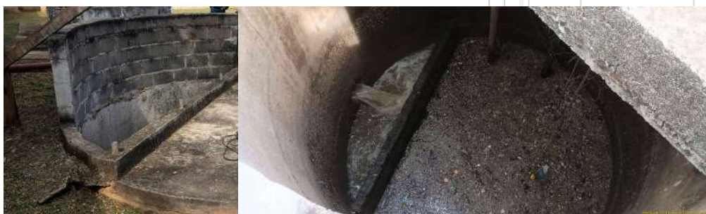
Foto 7 - Poço de sucção.
