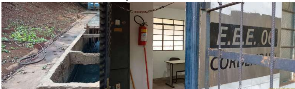
Foto 7 - Vista do canal de chegada do esgoto e gradeamento.
