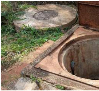
Foto 9 - Poço seco dos conjuntos motobomba.
