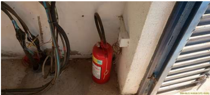
Foto 1 - Extintor de incêndio do local.
