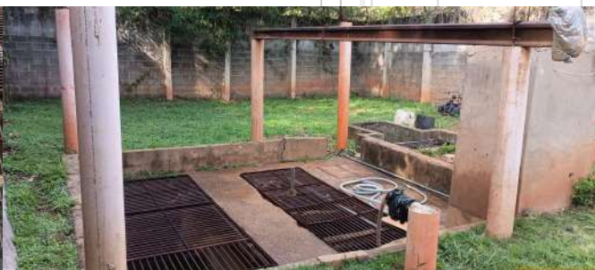
Foto 10 - Vista geral da EEE.
