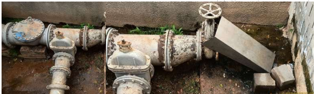
Foto 1 - Vazamento no barrilete de recalque.
