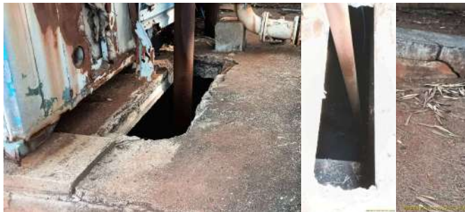
Foto 1 - Situação do poço de sucção da EEE.
