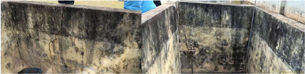
Foto 5 - Rachadura na mureta no entorno do poço de acesso ao gradeamento.
