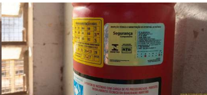
Foto 2 - Validade do extintor com prazo adequado.
