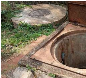
Foto 9 - Poço seco dos conjuntos motobomba.
