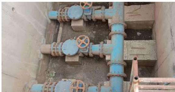
Foto 9 - Barrilete de recalque do esgoto.
