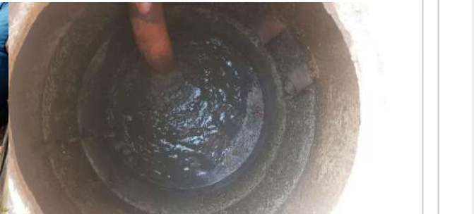
Foto 10 - Poço de sucção (Fonte: DAE Americana, 30/08/2024).
