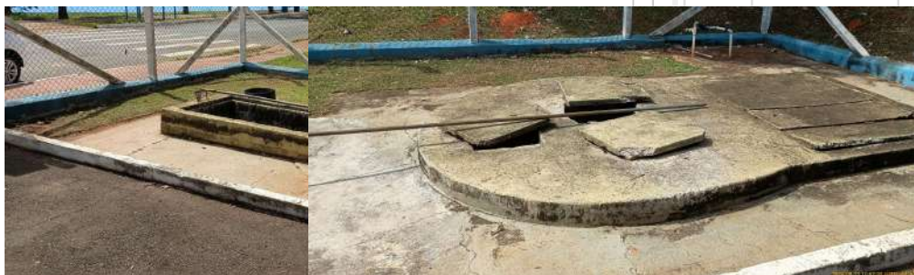
Foto 1 - Ausência de grade
