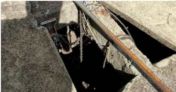
Foto 10 - Vão com correntes de sustentação das bombas submersas instaladas.
