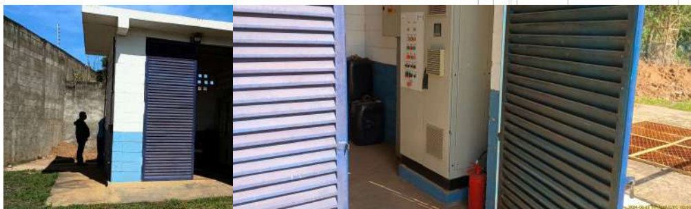
Foto 3 - Vista do abrigo do gerador de energia elétrica a diesel
