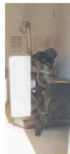
Foto 6 - Gerador de energia elétrica a diesel.
