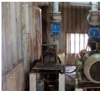
Foto 9 - Conjuntos motobomba instalados na EEE: B1 (esquerda e sem motor), B2 (centro) e B3 (direita).
