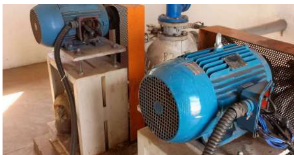
Foto 1 - Exposição dos fios da ligação elétrica dos motores.
