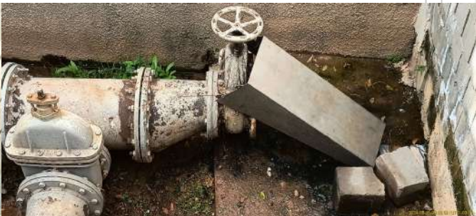
Foto 2 - Vazamento no barrilete de recalque.
