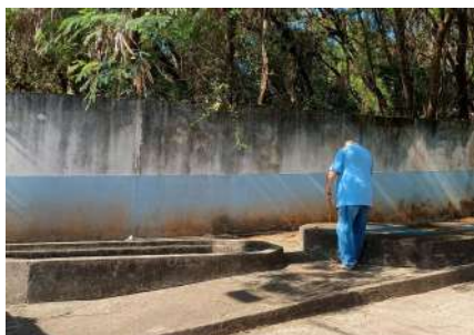
Foto 4 - Vista geral interna da EEE.
