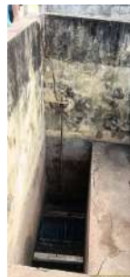
Foto 7 - Rachadura na mureta no entorno do poço de acesso ao gradeamento.
