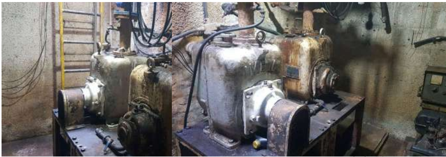
Foto 11 - Conjuntos girantes da EEE (apenas um está acoplado a motor elétrico). (Fonte: DAE Americana, 30/08/2024).
