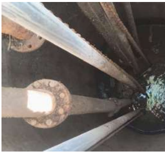
Foto 8 - Poço de sucção, com motobombas submersas.
