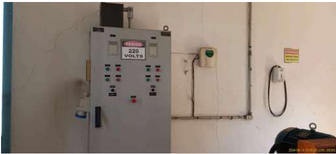
Foto 17 - Pannel elétrico e de comando da EEE.
