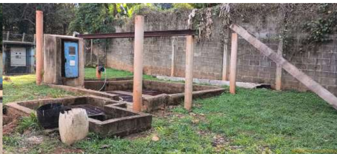
Foto 4 - Vista geral interna da EEE.
