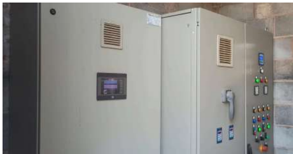
Foto 11 - Pannel elétrico e de comando da EEE.
