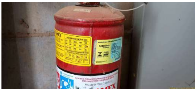
Foto 1 - Validade do extintor dentro do prazo regular.
