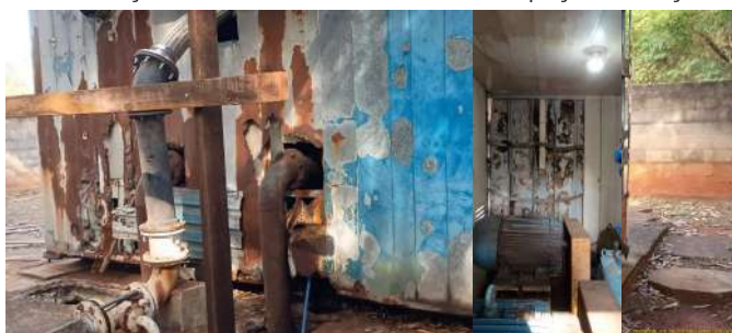
Foto 3 - Tubulações de sucção.
