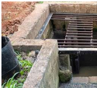
Foto 5 - Local de chegada do esgoto e gradeamento.
