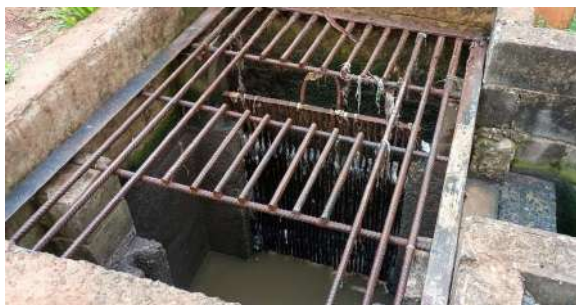
Foto 7 - Local de chegada do esgoto e gradeamento.
