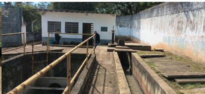
Foto 4 - Canal de chegada do esgoto e abrigo dos conjuntos motobomba (ao fundo).
