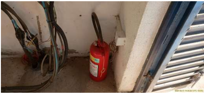
Foto 1 - Extintor de incêndio do local.
