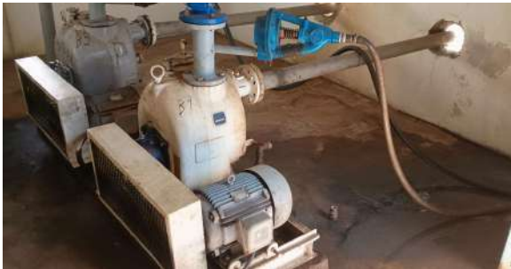
Foto 1 - Detalhe do piso molhado no entorno do primeiro conjunto motobomba.
