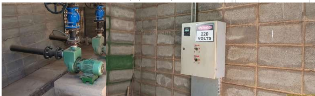
Foto 7 - Conjuntos motobomba da EEE.
