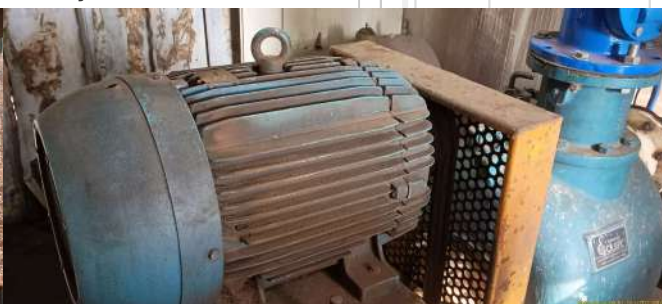
Foto 13 - Motor de um dos conjuntos motobomba.
