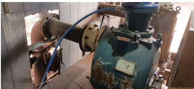
Foto 14 - Tubulação de sucção de um dos conjuntos motobomba.
