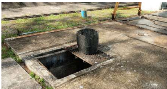
Foto 7 - Poço de chegada do esgoto e gradeamento.
