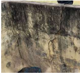
Foto 5 - Rachadura na mureta no entorno do poço de acesso ao gradeamento.
