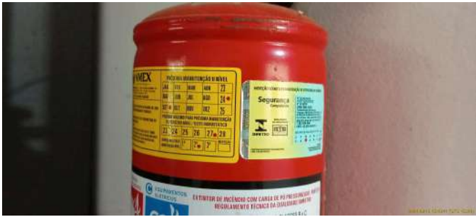
Foto 1 - Validade do extintor de incêndio dentro do prazo adequado.
