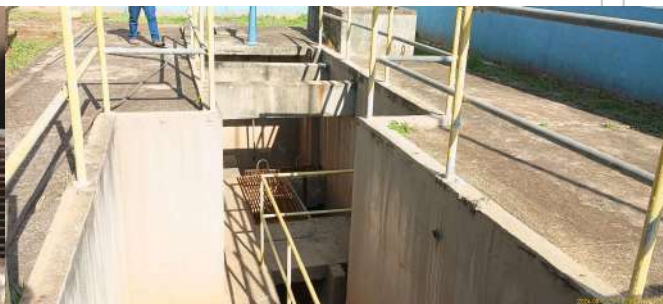
Foto 6 - Vista do canal de chegada e gradeamento.
