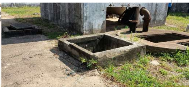
Foto 6 - Poço de sucção e caixa de registros da tubulação.
