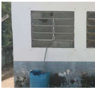
Foto 11 - Entrada do abrigo dos conjuntos motobomba e painéis elétricos.
