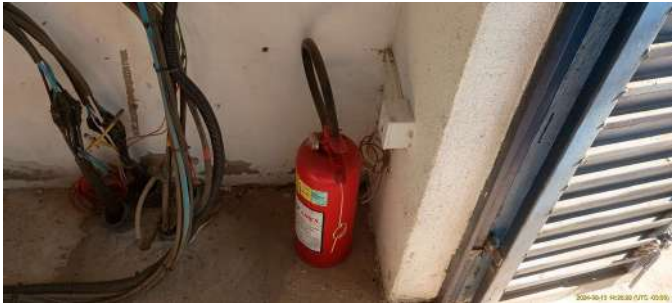
Foto 1 - Extintor de incêndio do local.
