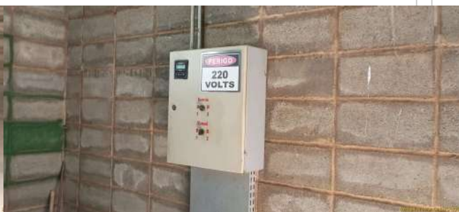
Foto 8 - Painel elétrico e de comando da EEE.
