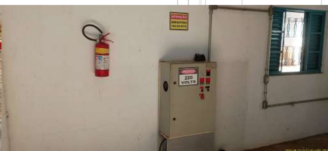
Foto 13 - Extintor de incêndio do local.
