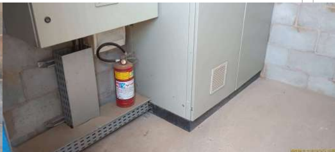
Foto 12 - Extintor de incêndio da EEE próximo aos painéis elétricos.
