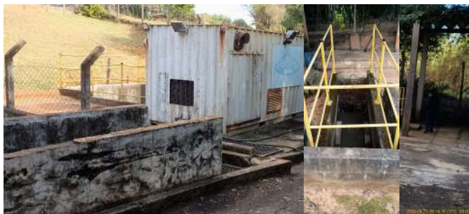
Foto 3 - Abrigo dos conjuntos motobomba.
