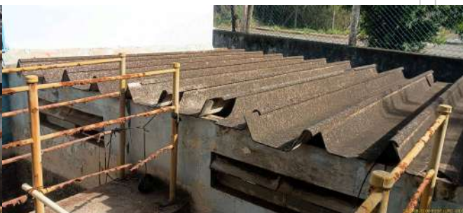
Foto 4 - Situação dos guarda-corpo dos tanques de sucção.
