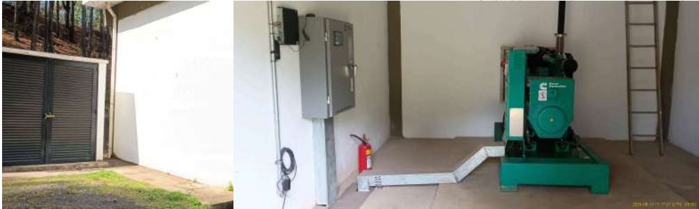
Foto 3 - Vista do abrigo dos painéis elétricos e de comando e do gerador de energia a diesel.
