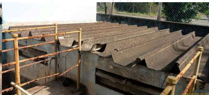
Foto 4 - Situação dos guarda-corpo dos tanques de sucção.
