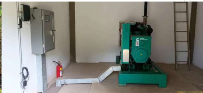
Foto 4 - Pannel elétrico e de comando e gerador de energia a diesel.
