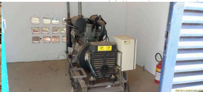
Foto 7 - Gerador de energia a diesel.
