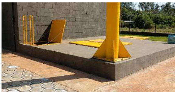
Foto 9 - Poço seco dos conjuntos motobomba.
