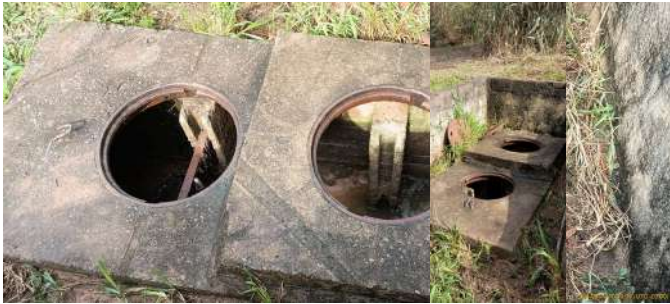
Foto 3 - Poços de chegada e gradeamento da EEE.
