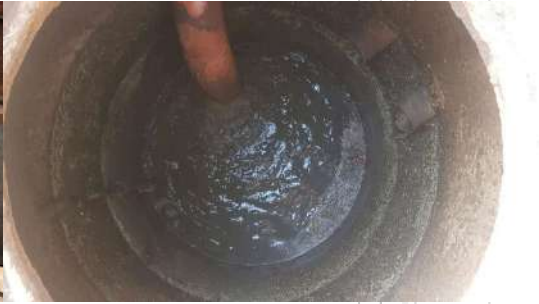
Foto 10 - Poço de sucção (Fonte: DAE Americana, 30/08/2024).
