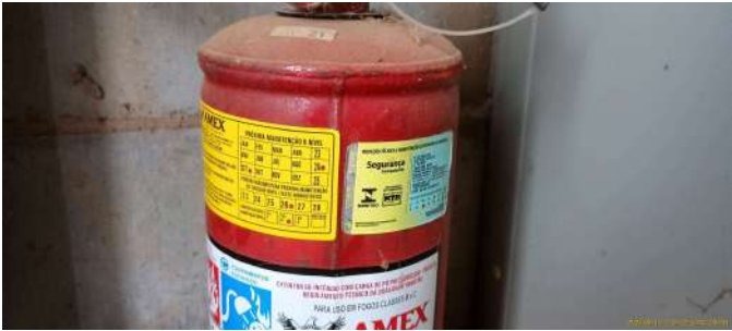
Foto 1 - Validade do extintor dentro do prazo regular.
