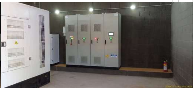
Foto 6 - Painel elétrico e de comando da EEE.
