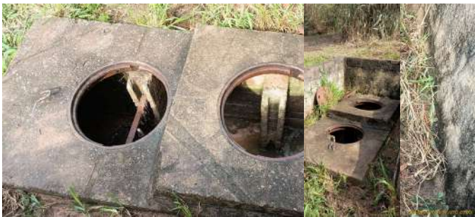
Foto 3 - Poços de chegada e gradeamento da EEE.
