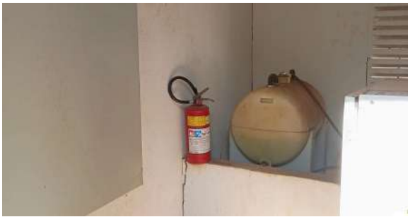
Foto 7 - Extintor de incêndios no abrigo do gerador de energia elétrica.
