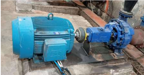
Foto 16 - Segundo conjunto motobomba.
