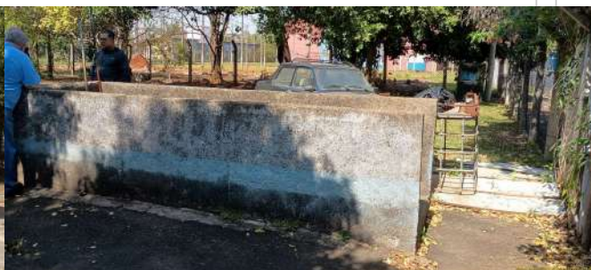
Foto 2 - Local de chegada do esgoto dentro da EEE e gradeamento.
