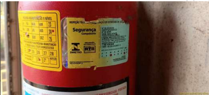
Foto 2 - Validade do extintor dentro do prazo adequado.
