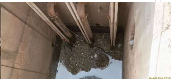
Foto 8 - Poço de sucção, com motobomba submersas.
