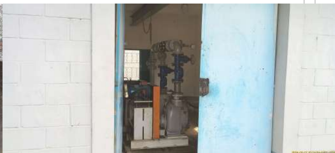
Foto 10 - Vista interna do abrigo dos conjuntos motobomba.
