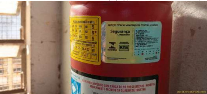
Foto 2 - Validade do extintor com prazo adequado.
