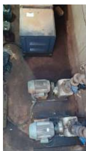
Foto 17 - Conjuntos motobomba da antiga EEE 17, que serão removidos e realocados.(Fonte: DAE Americana, 2024).
