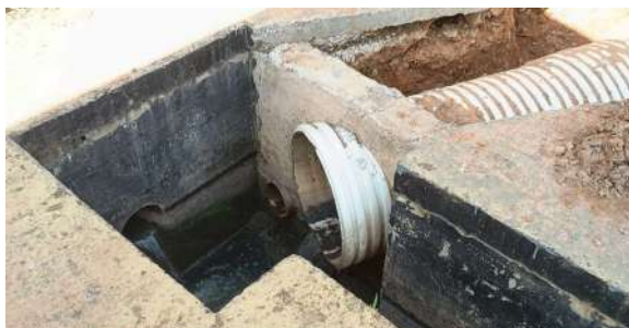
Foto 6 - Tubulações de chegada do esgoto na EEE.
