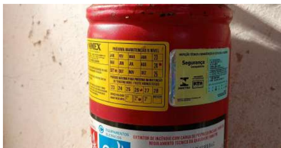
Foto 1 - Validade do extintor com prazo adequado.
