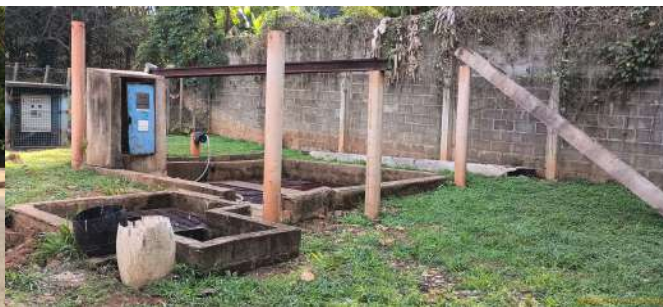
Foto 4 - Vista geral interna da EEE.
