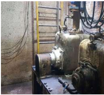
Foto 11 - Conjuntos girantes da EEE (apenas um está acoplado a motor elétrico). (Fonte: DAE Americana, 30/08/2024).
