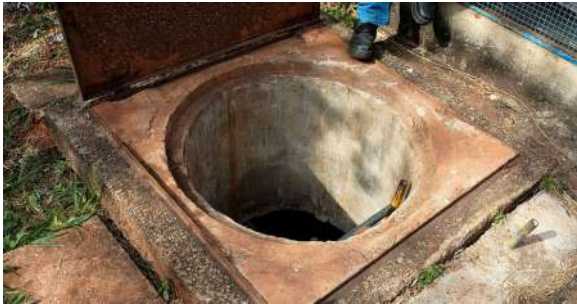
Foto 7 - Poço seco dos conjuntos motobomba.
