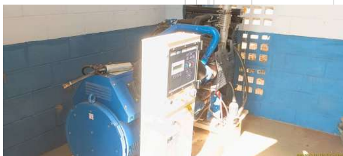
Foto 5 - Gerador de energia elétrica a diesel.
