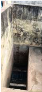
Foto 7 - Rachadura na mureta no entorno do poço de acesso ao gradeamento.
