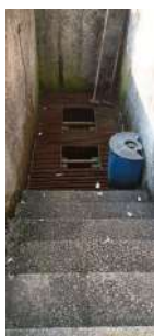
Foto 3 - Vista interna do local de chegada do esgoto na EEE e onde ocorre o gradeamento.
