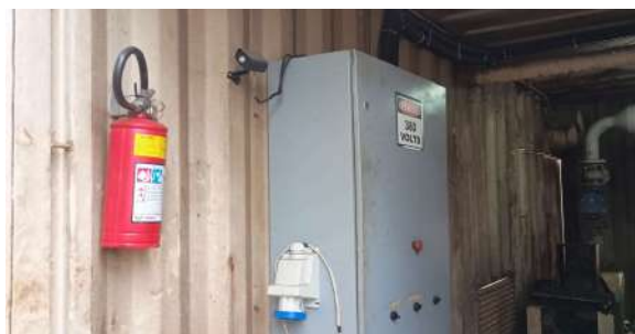
Foto 8 - Extintor de incêndio dentro do abrigo e painel elétrico e de comando.
