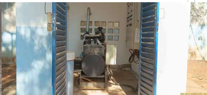
Foto 9 - Abrigo do gerador de energia elétrica a diesel.
