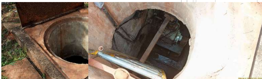
Foto 7 - Poço seco dos conjuntos motobomba.
