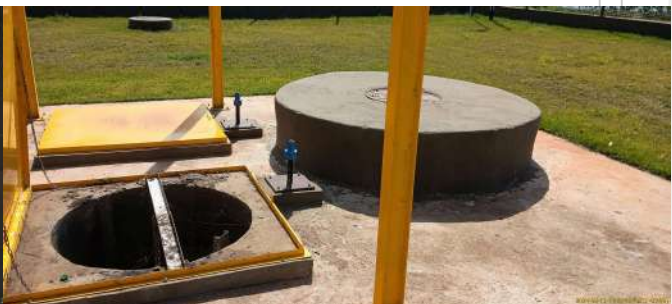
Foto 8 - Poços de chegada e gradeamento do esgoto bruto.
