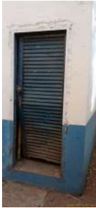
Foto 4 - Porta danificada na parte inferior.
