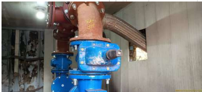
Foto 11 - Barrilete das tubulações de saída da EEE.
