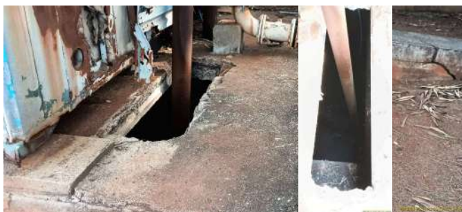
Foto 1 - Situação do poço de sucção da EEE.
