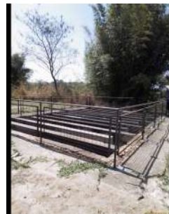
Foto 21 - Tanque com chicanas para desinfecção, procedimento que não estava em operação.
