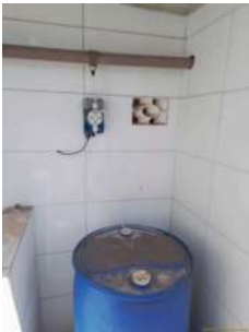
Foto 3 - Armazenamento e dosagem de flúor.
