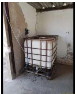
Foto 8 - Não está sendo realizada desinfecção no tanque de chicanas. O tanque de hipoclorito de sódio estava vazio.
