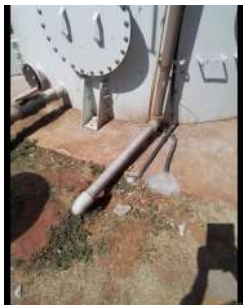
Foto 3 - Alimentação do reservatório a partir do poço 3.
