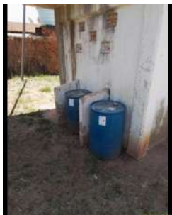
Foto 3 - Bombonas para armazenamento de cloro e flúor. Serão realocadas para o novo abrigo de produtos químicos.
