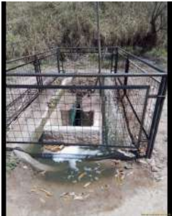
Foto 1 - Extravasamento de esgoto na calha parshall da saída, antes das chicanas.
