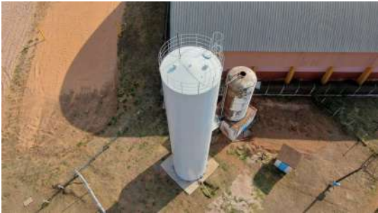
Foto 1 - Imagem aérea do reservatório novo do poço 1, já em operação. Também observa-se o reservatório antigo, que foi desativado.
