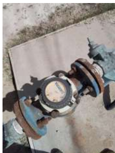
Foto 1 - Medidor de vazão instalado, mas sem uso.
