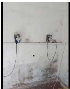
Foto 1 - Bomabs dosadoras de cloro e flúor.
