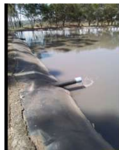
Foto 15 - Tubulações para entrada do efluente na lagoa facultativa, após a lagoa anaeróbia.
