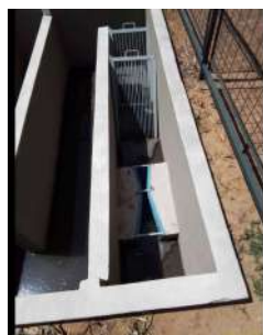
Foto 2 - Calha parshall do tratamento preliminar executado por empreendedor de loteamento.
