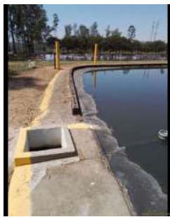
Foto 18 - Caixa de saída da lagoa anaeróbia para lagoa facultativa.
