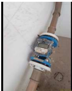
Foto 1 - Macromedidor na saída do poço.
