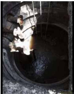
Foto 2 - Vista do poço de sucção.
