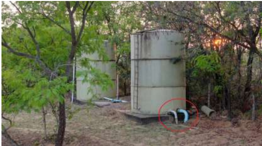
Foto 1 - Nesta imagem verifica-se um vazamento na base de um dos reservatórios, possivelmente proveniente de tubulação ou conexão. deve ser avaliado pelo prestador.
