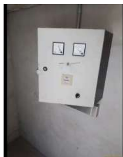
Foto 4 - Painel elétrico da bomba.
