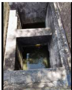
Foto 25 - Saída do tanque de chicanas.
