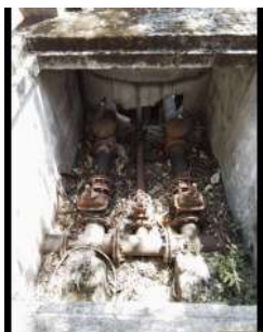
Foto 4 - Barrilete da tubulação de recalque.
