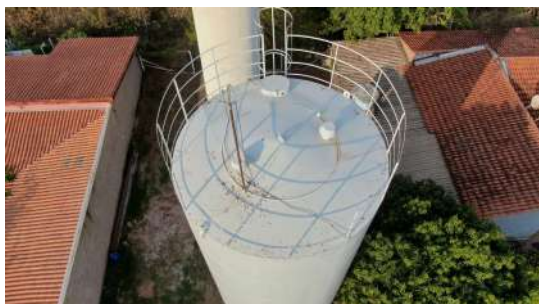
Foto 3 - Para-raios na cobertura do reservatório.
