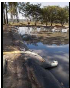
Foto 16 - Tubulações para entrada do efluente na lagoa facultativa, após a lagoa anaeróbia.
