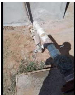
Foto 1 - Torneira para coleta de água bruta no cavalete do poço.
