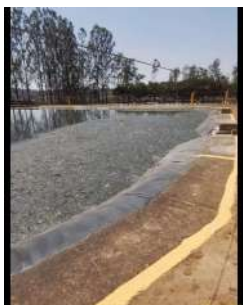
Foto 1 - Escuma e sobrenadante acumulados na lagoa anaeróbia, próximo à entrada do efluente na lagoa.
