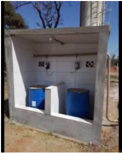
Foto 1 - Novo abrigo de produtos químicos do poço. Será instalada grade.
