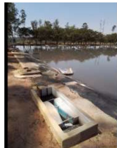
Foto 13 - Calha parshall para medição da vazão na ocasião de manutenção da lagoa facultativa, quando o efluente passa diretamente vindo da lagoa anaeróbia, funcionando como by pass.
