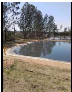
Foto 8 - Vista da lagoa anaeróbia.
