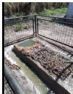
Foto 6 - Extravasamento de efluente.
