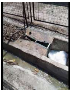
Foto 3 - Calha parshall antes do tanque de chicanas.
