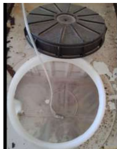
Foto 9 - Tanque de hipoclorito de sódio vazio.
