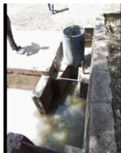
Foto 3 - Calha parshall após a caixa de areia, antes do poço de sucção.
