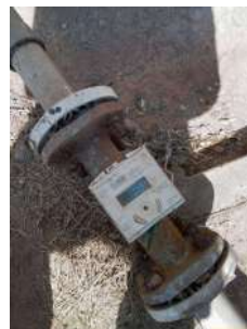
Foto 2 - Medidor de vazão digital, na tubulação de recalque do poço.
