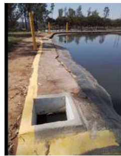
Foto 19 - Caixa de saída da lagoa anaeróbia para lagoa facultativa.
