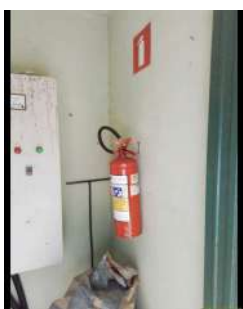
Foto 1 - Extintor junto ao painel de comando da bomba.
