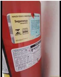
Foto 1 - Manutenção do extintor.
