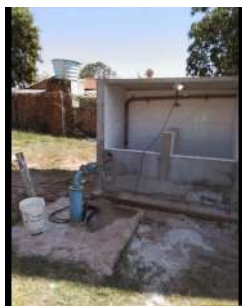
Foto 5 - Poço e novo abrigo de produtos químicos.
