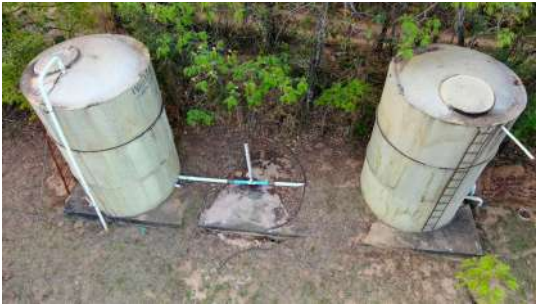
Foto 2 - Dois reservatórios abastecidos pelo poço 7, antiga ETA.
