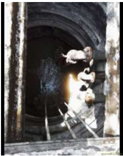
Foto 1 - Sólidos no poço de sucção após o gradeamento, indicando deficiência na limpeza da estação.
