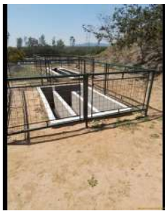
Foto 1 - À frente, tratamento preliminar construído por empreendedor para receber efluente exclusivamente vindo de loteamento que não encaminha o esgoto para a Estação Elevatória. Atrás, caixa de areia da ETE que recebe toda a contribuição que chega à estação.
