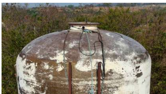
Foto 1 - A saída para extravasão possibilita a ventilação. Contudo, deve ser vedada com tela, item apontado como não conforme.
