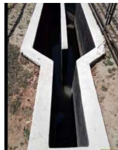
Foto 5 - Entrada do efluente na caixa de areia da ETE, vindo da estação elevatória. O efluente se junta ao esgoto que passa pelo tratamento preliminar.
