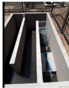
Foto 2 - Tratamento preliminar de loteamento que não encaminha o efluente para a elevatória, vindo diretamente para a ETE. Foi executado às expensas do empreendedor.
