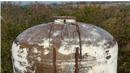
Foto 1 - Ausência de tela de proteção na tubulação.
