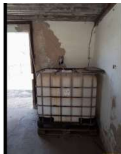
Foto 10 - Tanque para armazenamento de hipoclorito de sódio: vazio na ocasião da Fiscalização.
