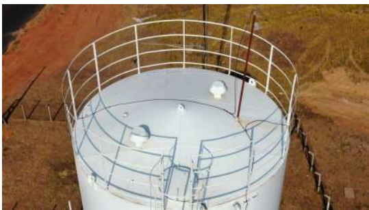
Foto 1 - Chaminés de ventilação na cobertura.
