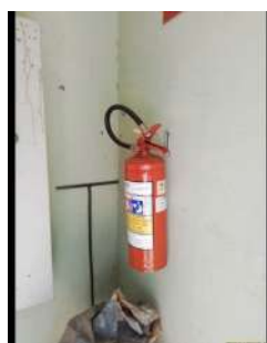
Foto 2 - Extintor junto ao painel de comando da bomba.
