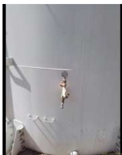
Foto 1 - Manômetro instalado para aferição do nível do reservatório.
