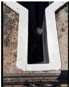
Foto 6 - Entrada do efluente na caixa de areia.
