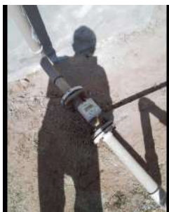
Foto 3 - Medidor de vazão digital.
