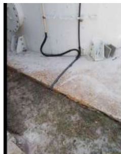
Foto 2 - Aterramento do SPDA.
