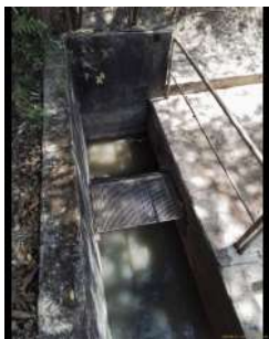
Foto 1 - Entrada do efluente na estação elevatória.
