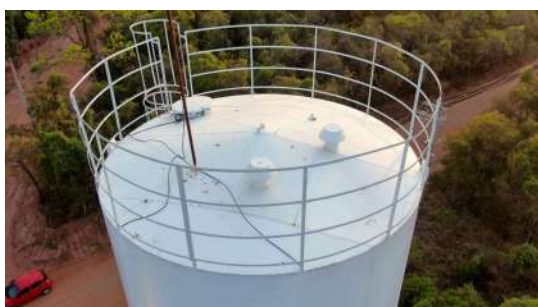
Foto 1 - Chaminés de ventilação na cobertura do reservatório.
