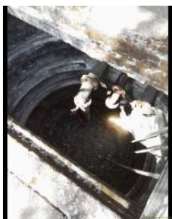
Foto 1 - No momento havia apenas uma bomba submersa instalada. Segundo o DAE, outra bomba estava em manutenção.
