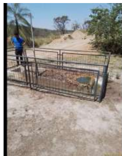
Foto 4 - Folhas e resíduos acumulados na calha parshall da saída estão causando extravasamento de efluente.
