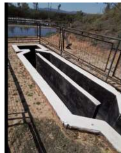
Foto 7 - Caixa de areia da ETE.
