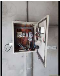
Foto 1 - Painel de comando da bomba do poço, já instalado no novo abrigo.
