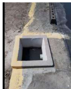
Foto 17 - Caixa de saída da lagoa anaeróbia para lagoa facultativa.
