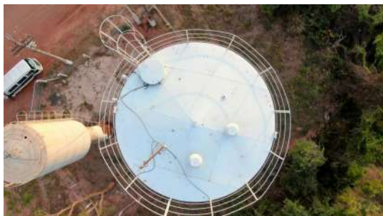
Foto 1 - Para-raios na cobertura do reservatório.
