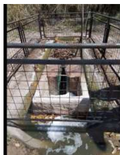
Foto 4 - Calha parshall antes do tanque de chicanas. Observa-se o extravasamento de efluente e acúmulo de sedimentos e folhas.
