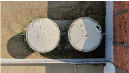
Foto 2 - Aberturas na cobertura do reservatório.
