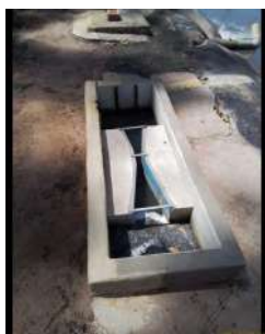
Foto 1 - Calha parshall entre a lagoa anaeróbia e a lagoa facultativa.
