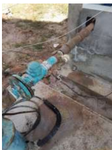
Foto 1 - Torneira para coleta de água bruta.
