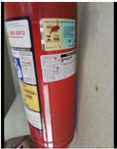
Foto 1 - Manutenção do extintor.
