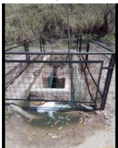
Foto 5 - Folhas e resíduos acumulados na calha parshall da saída estão causando extravasamento de efluente.
