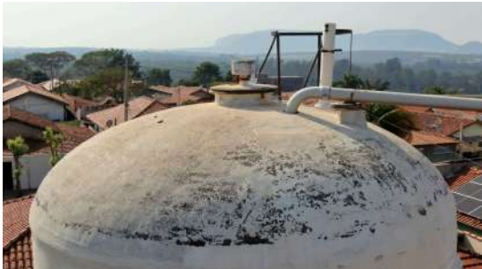
Foto 1 - Chaminé de ventilação.
