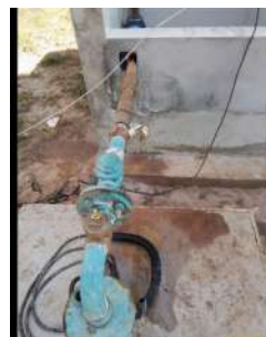
Foto 2 - Torneira para coleta de água bruta.
