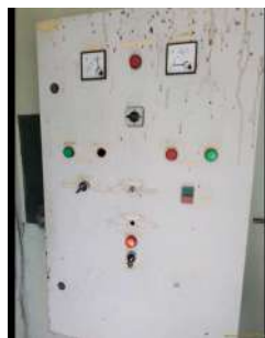
Foto 7 - Painel de comando da bomba.
