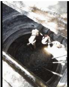
Foto 1 - Verificou-se presença de sólidos no poço de sucção.
