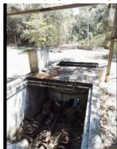
Foto 5 - Visão do barrilete e do poço de sucção.
