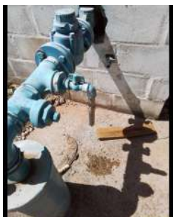
Foto 1 - Torneira para tomada de água bruta.
