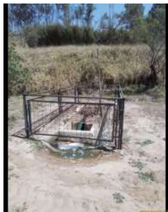
Foto 20 - Calha parshall para medição da saída, situada antes do tanque de chicanas. Estava com muitos resíduos e extravasando.
