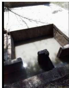
Foto 2 - Caixa de areia.
