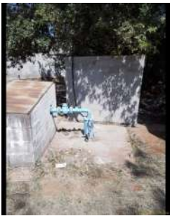
Foto 2 - Cavalete do poço.
