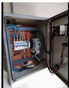
Foto 3 - Painel elétrico da bomba.
