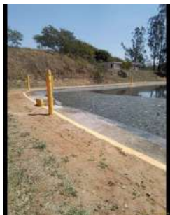
Foto 3 - Escuma e sobrenadante acumulados na lagoa anaeróbia, próximo à entrada do efluente na lagoa.
