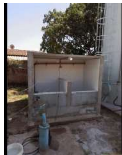
Foto 2 - Novo abrigo de produtos químicos. Atrás também está a nova cabine de comando da bomba, abrigando o painel elétrico.
