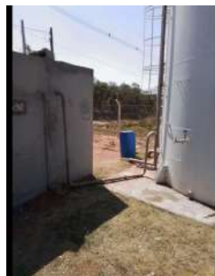
Foto 2 - Alimentação do reservatório a partir do poço 6.
