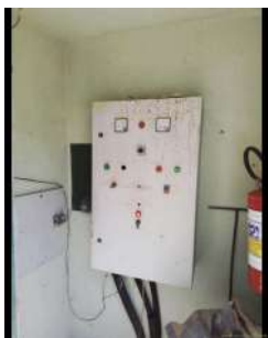
Foto 6 - Painel de comando da bomba.
