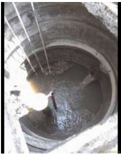
Foto 4 - Presença de quantidade significativa de sólidos no poço de sucção.
