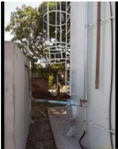
Foto 2 - Abastecimento do reservatório a partir do poço 5.
