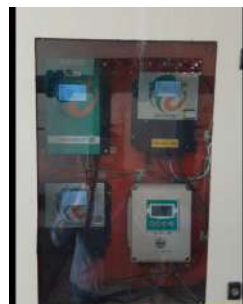
Foto 2 - Macromedidores de saída da água tratada.
