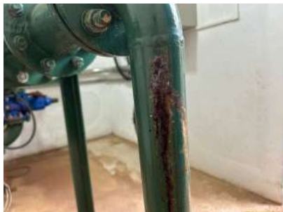
Foto 3 - Detalhe do ponto com vazamento.
