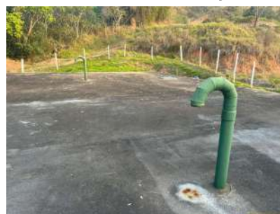
Foto 4 - Tubo de ventilação 2.
