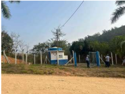
Foto 5 - Vista externa do local em que há o poço, o booster e o reservatório São Germano.
