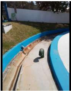
Foto 1 - Canaleta para escoamento de água.
