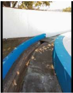
Foto 2 - Canaleta terminando na caixa coletora, que está ligada ao sistema de águas pluviais.
