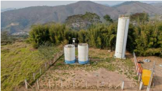
Foto 1 - Vista aérea do sistema de reservação.
