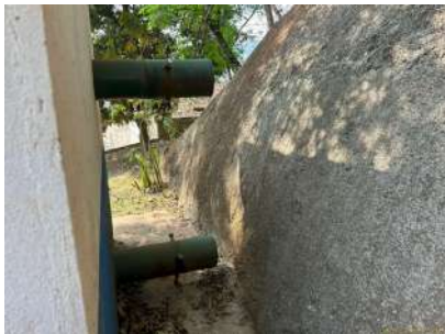
Foto 4 - Tubulação das bombas submersas utilizadas na elevatória.
