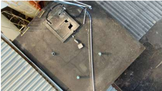
Foto 1 - Detalhe das aberturas na tampa do reservatório.
