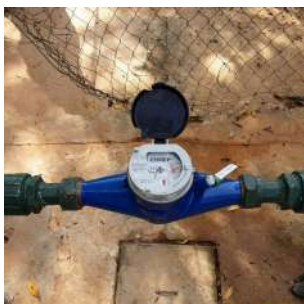
Foto 1 - Detalhe do macromedidor.
