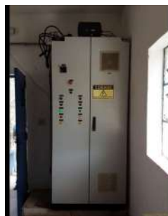
Foto 9 - Painelelétrico instalado no piso superior da casa de bombas.
