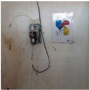
Foto 3 - Bomba dosadora de Hipoclorito de Sódio.
