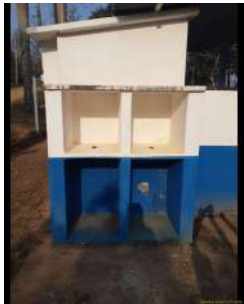
Foto 1 - Estruturas construídas para abrigar os tanques e bombas dosadoras de Ácido Fluossilícico e Hipoclorito de Sódio.
