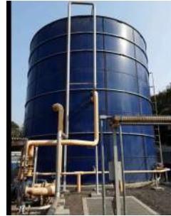
Foto 8 - Reator biológico de fluxo ascendente - a porção inferior funciona como um reator anaeróbico e a superior como reator aeróbico.
