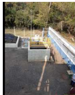
Foto 2 - Tanque de mistura do polímero ao lodo.
