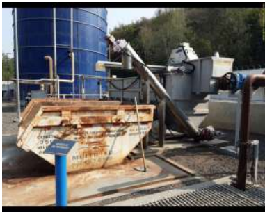
Foto 4 - Detalhe do maquinário do sistema de tratamento preliminar em uso.
