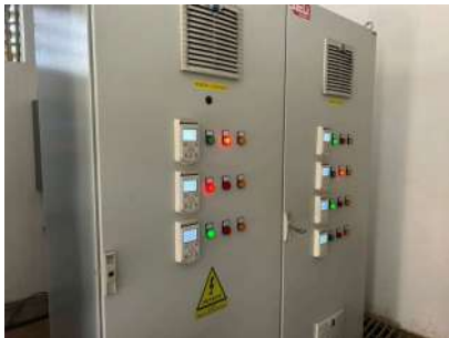
Foto 3 - Painelelétrico da elevatória.
