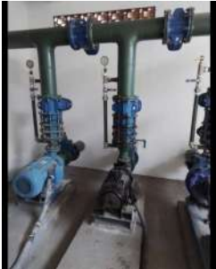
Foto 3 - O vazamento foi verificado em tubulação do conjunto motobomba de cor preta.
