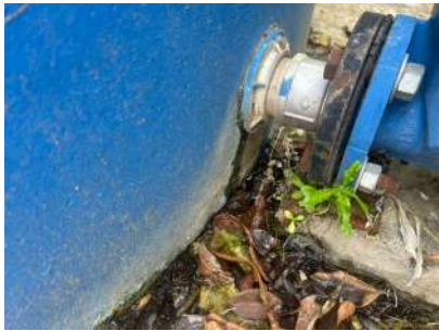
Foto 1 - Vazamento no reservatório.
