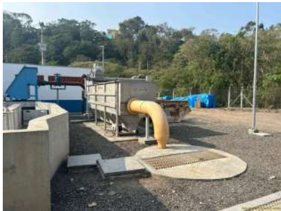
Foto 1 - Elevatória localizada após o tratamento preliminar da EPAR.
