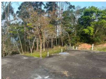
Foto 3 - Área elevada, com tampa de inspeção e sem guarda-corpos.
