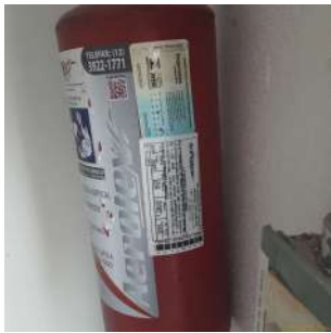
Foto 1 - Detalhe da etiqueta de controle de manutenções do extintor - dentro da validade.
