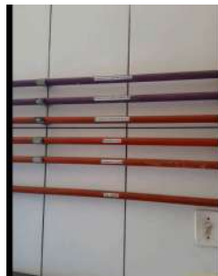
Foto 14 - Tubulação que sai das bombas dosadoras, etiquetadas e com coloração adequada para fácil identificação do produto.
