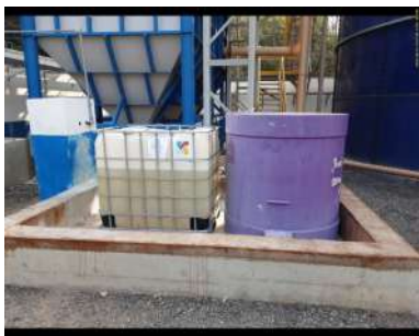
Foto 1 - Dique de contenção do container de armazenamento de Hipoclorito de Sódio - o tanque de cor roxa está desativado.
