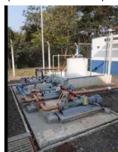
Foto 3 - Bombas de circulação de lodo e aplicação de polímero. No fundo, tanque de polímero no dique de contenção.
