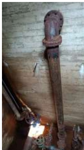
Foto 1 - Tubo extravasor no interior da câmara de válvulas e registros do reservatório.
