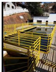
Foto 2 - Detalhe dos guarda-corpos do decantador 1 e filtros.
