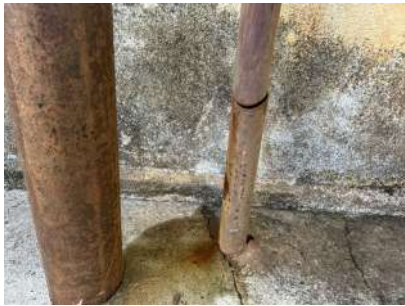
Foto 1 - Extravasador sem tela de proteção.
