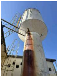
Foto 1 - Detalhe do ponto de vazamento no reservatório.
