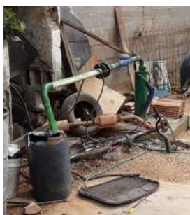
Foto 1 - Apesar de estar localizado no interior de uma propriedade particular cercada, não há qualquer tipo de proteção das estruturas do poço, sendo possível observar o acúmulo de objetos no entorno do cavalete.
