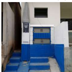
Foto 3 - Painel elétrico da bomba do poço instalado em frente à UBS.
