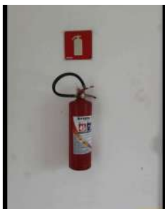
Foto 1 - Extintor de incêndio instalado no interior da casa de bombas.
