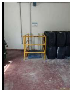
Foto 7 - Vista geral do piso superior da casa de bombas, no centro, a tampa do poço das bombas.
