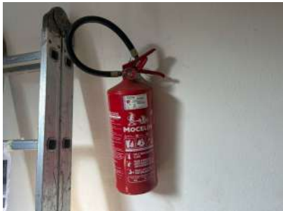
Foto 1 - Extintor localizado no edifício anexo à EPAR.
