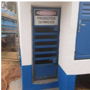
Foto 2 - Porta da casa de química devidamente identificada.
