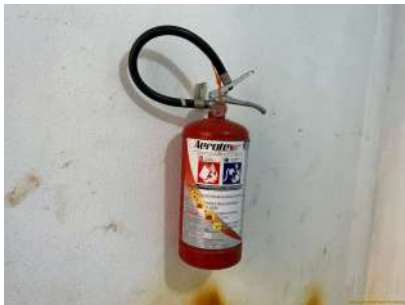
Foto 1 - Extintor de incêndio instalado no interior da edificação.
