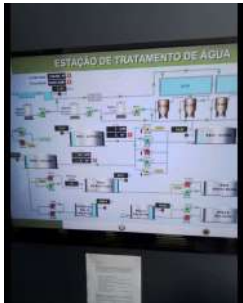
Foto 7 - Visualização dos sistema de bombeamento da elevatória central no CCO da concessionária. Observa-se as 5 bombas, a sucção do reservatório central e recalque para os reservatórios Zé Pedro e Camargo, bem como os respectivos medidores de vazão.
