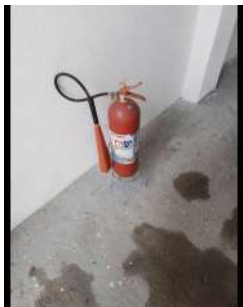
Foto 1 - Extintor de incêndio na elevatória.
