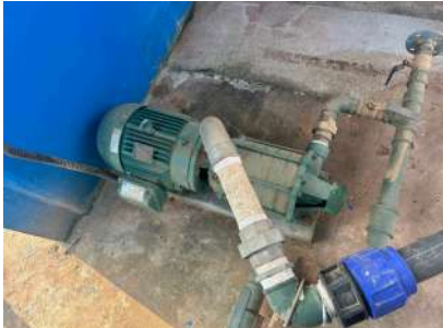
Foto 3 - Bomba da elevatória.
