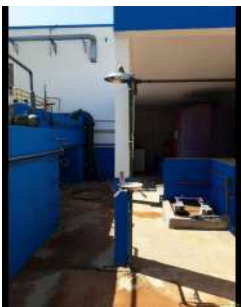
Foto 1 - Chuveiro de emergência instalado próximo aos tanques de produtos químicos.
