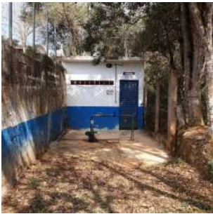
Foto 1 - Vista geral das instalações do poço, ao fundo, edificação que abriga as bombas dosadoras, tanques de produtos químicos e painel elétrico.
