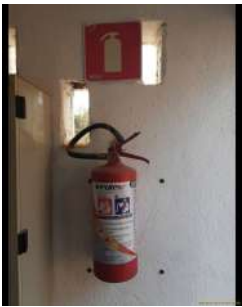
Foto 1 - Extintor de incêndio instalado no interior da edificação de apoio.
