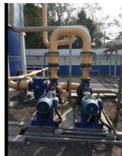
Foto 10 - Bombas que promovem a circulação do efluente dentro do reator biológico.
