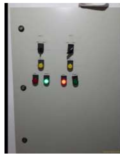
Foto 2 - Detalhe do painel elétrico de controle das bombas, uma em uso e a reserva desligada.
