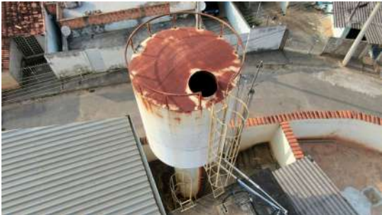
Foto 1 - Reservatório sem tubulação de ventilação.
