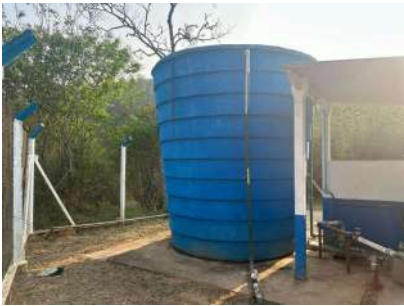
Foto 2 - Entrada de água do reservatório Colinas II.
