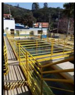
Foto 3 - Detalhe dos guarda-corpos do decantador 2 e filtros.
