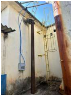
Foto 1 - Guarda-corpos na escada de acesso ao topo do reservatório.
