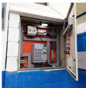
Foto 4 - Detalhe do interior do painel elétrico.
