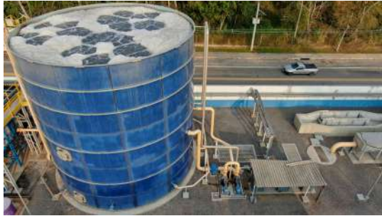
Foto 7 - Vista aérea das estruturas do tratamento biológico.
