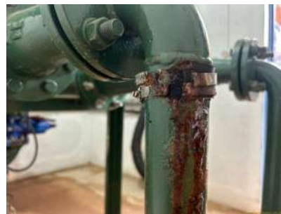
Foto 2 - Detalhe do ponto com vazamento.
