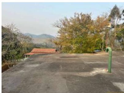
Foto 1 - Área elevada, com tampa de inspeção e sem guarda-corpos.
