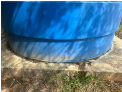
Foto 2 - Área molhada no entorno do reservatório, indicando a existência do vazamento.
