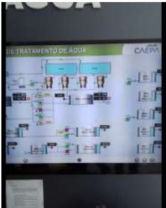
Foto 1 - Visualização do nível do reservatório central no CCO.
