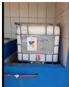
Foto 4 - Tanque de Policloreto de Alumínio no dique de contenção.
