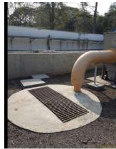
Foto 6 - Poço de bombeamento com quatro bombas que recalcam o efluente pré-tratado para o reator biológico (Estação Elevatória de Esgoto nº 2).
