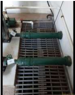
Foto 4 - Detalhe da tubulação de recalque.
