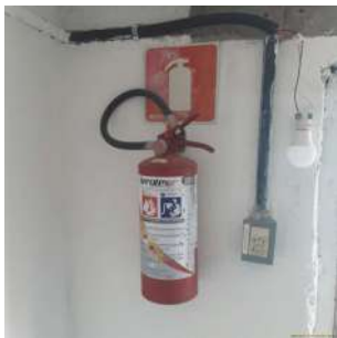
Foto 1 - Extintor de incêndio instalado no interior de casa de química localizada na área do Reservatório Telles.
