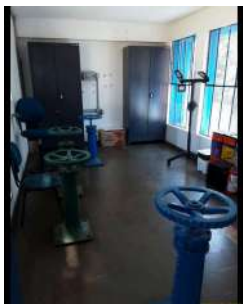
Foto 10 - Sala de manobras dos filtros.
