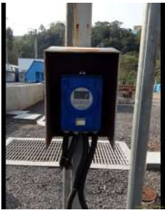
Foto 1 - Macromedidor de entrada do efluente bruto.
