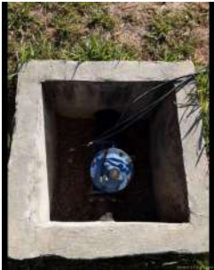
Foto 8 - Detalhe da válvula para controle da comunicação entre o reservatório elevado e os reservatórios apoiados.
