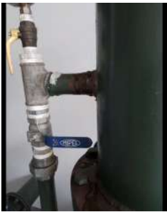
Foto 2 - Detalhe do vazamento.
