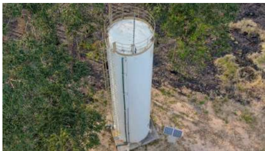
Foto 1 - Haste do para-raios no topo do reservatório.
