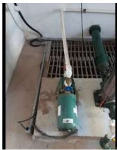
Foto 6 - Bomba que manda água para o reservatório Cuba Taça.
