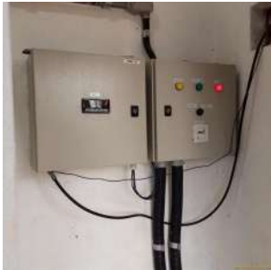
Foto 3 - Detalhe do painel elétrico no interior da edificação de apoio.
