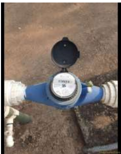
Foto 1 - Detalhe do macromedidor.
