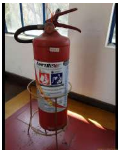
Foto 1 - Extintor de incêndio instalado na sala de manobras dos filtros.
