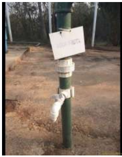
Foto 1 - Detalhe da torneira para amostragem de água bruta.
