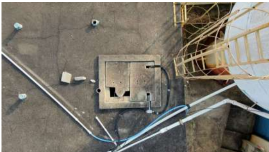
Foto 1 - Tubulação de ventilação que não impede a entrada de água de chuva.
