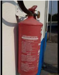
Foto 2 - Detalhe da etiqueta do extintor 2 - dentro da validade.
