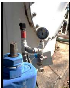
Foto 1 - Manômetro instalado na base do reservatório - serve como um medidor de nível in loco.
