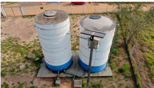
Foto 4 - Detalhe da ausência de guarda-corpos no topo dos reservatórios apoiados.
