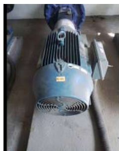
Foto 4 - Tag de uma das bombas.
