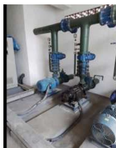
Foto 2 - Bombas da elevatória: 5 no total.
