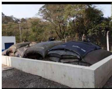
Foto 4 - Leito de desaguamento do lodo em geobags.
