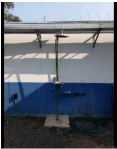
Foto 1 - Chuveiro de emergência instalado próximo à área de estocagem de produtos químicos.
