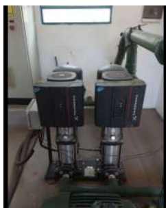
Foto 1 - Conjuntos de moto bomba da elevatória, uma em funcionamento e a segunda como reserva.
