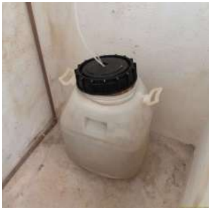
Foto 4 - Tanque de armazenamento de Hipoclorito de Sódio.
