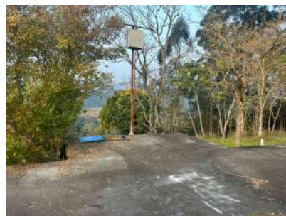
Foto 2 - Área elevada, com tampa de inspeção e sem guarda-corpos.
