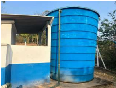
Foto 3 - Entrada de água do poço São Germano.
