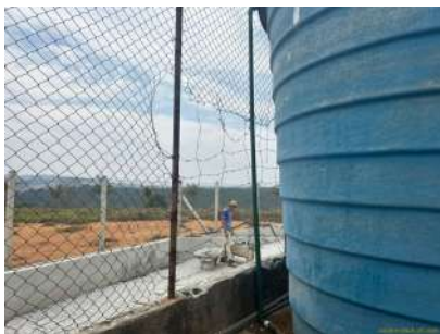
Foto 1 - Detalhe das falhas no cercamento.
