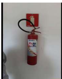
Foto 1 - Extintor de incêndio instalado no interior da edificação.
