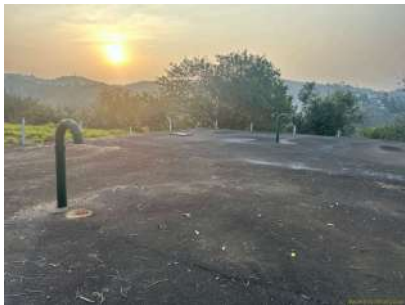
Foto 1 - Tubos de ventilação.
