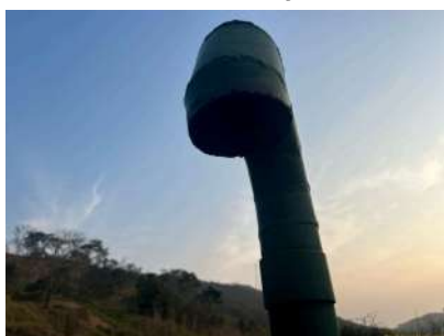
Foto 3 - Tubo de ventilação 2 sem tela.
