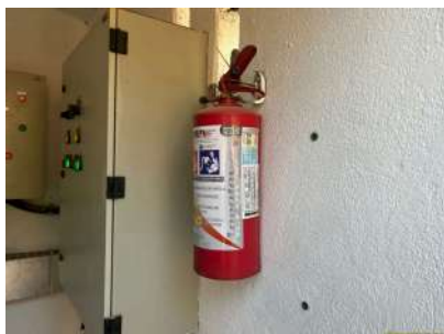
Foto 1 - Extintor de incêndio instalado na edificação anexa à elevatória.
