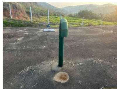
Foto 2 - Tubo de ventilação 1.
