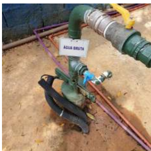
Foto 1 - Detalhe da torneira para amostragem de água bruta.
