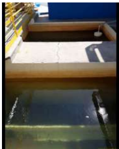
Foto 8 - Filtros do decantador 2.
