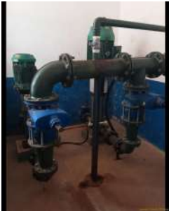
Foto 3 - Sala de bombas e tubulação.
