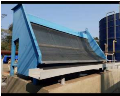
Foto 5 - Detalhe da peneira do sistema alternativo de tratamento preliminar, que não foi utilizado até o momento.
