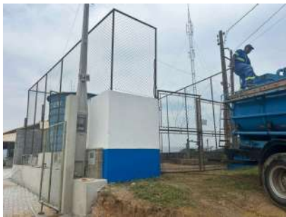
Foto 1 - Área sem identificação.
