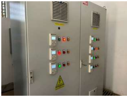
Foto 3 - Painel elétrico da elevatória.
