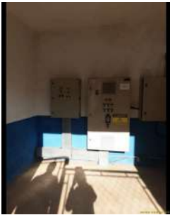
Foto 2 - Sala de painéis elétricos.
