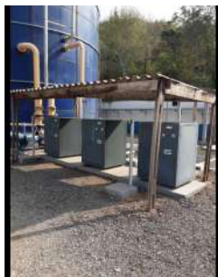
Foto 9 - Conjunto de sopradores que promovem a aeração da porção superior do reator biológico.
