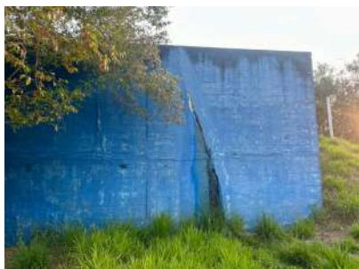
Foto 1 - Ponto com vazamento na parede do reservatório.
