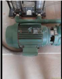
Foto 6 - Bomba antiga que permanece no local, mas sem uso.
