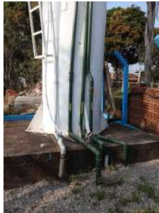
Foto 3 - Detalhe das tubulações de alimentação e saída do reservatório.
