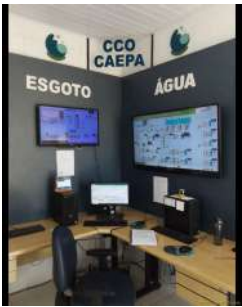
Foto 15 - Centro de Controle Operacional da CAEPA.
