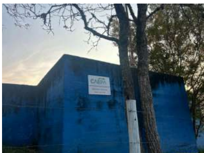
Foto 1 - Placa de identificação do reservatório.
