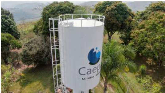
Foto 1 - Tubo extravasor no topo do reservatório.
