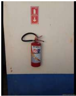
Foto 1 - Extintor de incêndio instalado na parede externa da estação elevatória.
