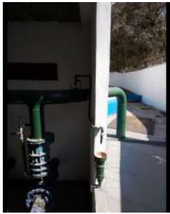
Foto 3 - Tubulação de recalque.
