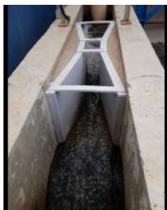
Foto 15 - Calha Parshal para passagem do efluente tratado.
