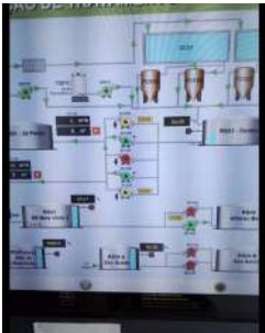
Foto 8 - Detalhe das bombas da elevatória central no sistema de telemetria da CCO.
