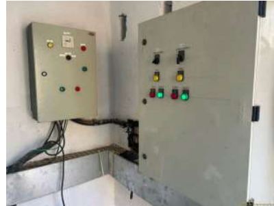
Foto 4 - Painéis elétricos da elevatória e do poço.
