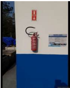
Foto 2 - Extintor 2 instalado na parede externa da edificação.
