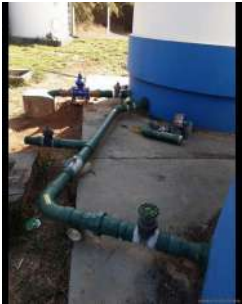
Foto 7 - Detalhe da tubulação de comunicação entre os reservatórios apoiados.
