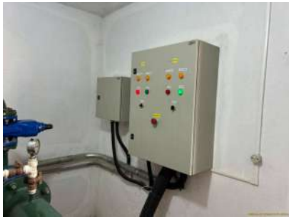
Foto 3 - Painel elétrico da elevatória.
