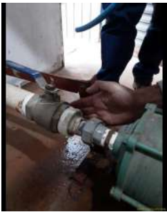
Foto 1 - Detalhe do ponto com vazamento.
