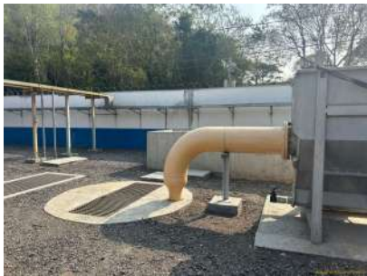
Foto 2 - Vista do poço da elevatória, onde é recebido o efluente do tratamento preliminar.
