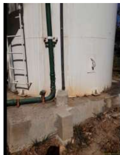
Foto 2 - Detalhe do aterramento do para-raios.
