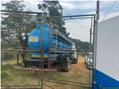
Foto 4 - Segundo a concessionária, devido à ocorrência de quatro vazamentos na área de abastecimento, no momento da visita estava ocorrendo o reforço do abastecimento do reservatório via caminhão pipa. Foi informado que
