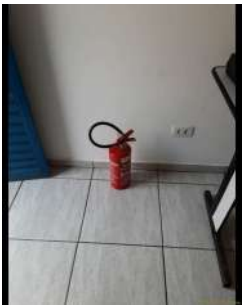
Foto 1 - Extintor 1 instalado no laboratório de apoio operacional.
