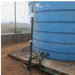
Foto 1 - Detalhe da tubulação de aplicação de Ácido Fluossilícico e Hipoclorito de Sódio na água bruta.
