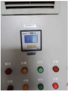
Foto 4 - Painel elétrico da elevatória.
