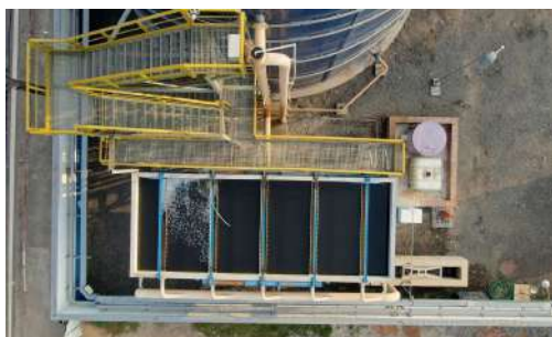
Foto 13 - Vista aérea do tanque de polimento.
