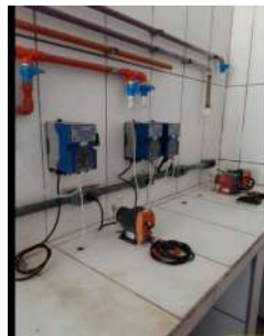
Foto 13 - Bancada de bombas dosadoras.
