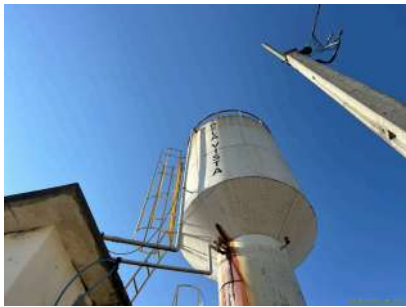
Foto 1 - Guarda-corpos na escada de acesso ao topo do reservatório.
