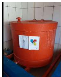
Foto 2 - Tanque de Ácido Fluossilícico no dique de contenção.
