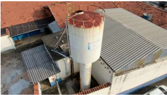
Foto 1 - Reservatório sem tubo extravasor.
