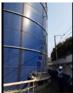
Foto 11 - Detalhe da tubulação e torneiras para amostragem do efluente em tratamento - controle operacional.
