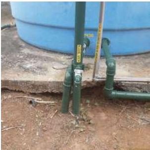
Foto 1 - Detalhe da torneira de amostragem da água bruta.
