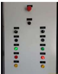
Foto 1 - Detalhe do painel elétrico de acionamento das bombas, uma bomba está em funcionamento e a segunda parada, atuando como bomba reserva.
