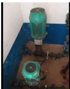
Foto 1 - Há duas bombas instaladas na estação, uma em funcionamento e a segunda como reserva.
