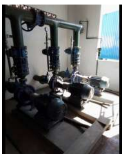
Foto 1 - Bombas da elevatória central.
