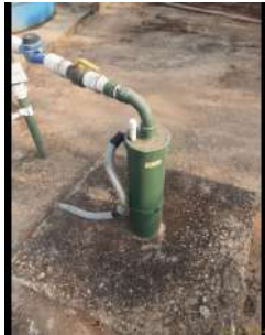
Foto 1 - Detalhe do tubo de medição de nível.
