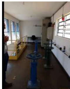
Foto 9 - Sala de manobras dos filtros.
