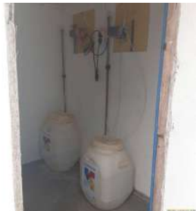
Foto 3 - Interior da casa de química - bombas dosadoras e tanques de armazenamento de Hipoclorito de Sódio e Ácido Fluossilícico.
