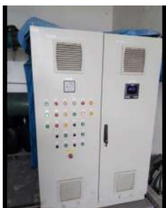
Foto 3 - Painel de comando das 5 bombas da elevatória.
