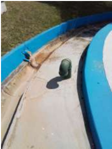
Foto 1 - Tubo de ventilação do reservatório.
