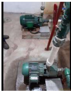
Foto 1 - Conjuntos de moto bomba da elevatória, uma em funcionamento e a outra como reserva.
