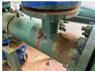
Foto 4 - Detalhe do ponto com vazamento.
