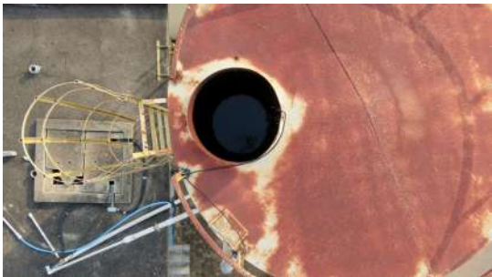
Foto 1 - Reservatório sem tampa de inspeção.
