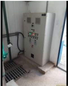
Foto 5 - Detalhe do painel elétrico de acionamento das bombas.
