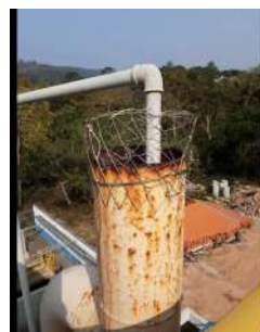
Foto 12 - Ponto de dosagem de Hipoclorito de Sódio no efluente que sai do reator biológico.
