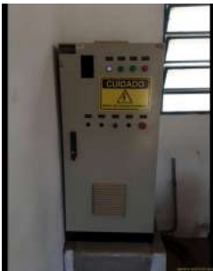
Foto 4 - Detalhe do painel elétrico da elevatória.
