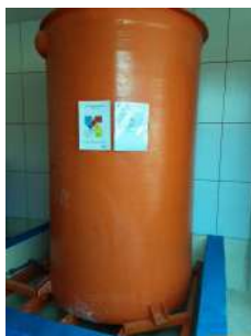
Foto 3 - Tanque de Policloreto de Alumínio no dique de contenção.
