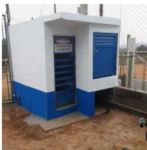
Foto 5 - Casa de química e painel elétrico localizados na área do Reservatório Telles.
