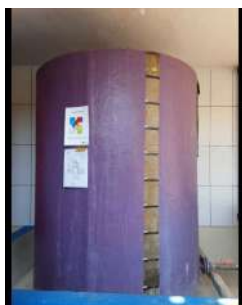
Foto 1 - Tanque de Hipoclorito de Sódio no dique de contenção.
