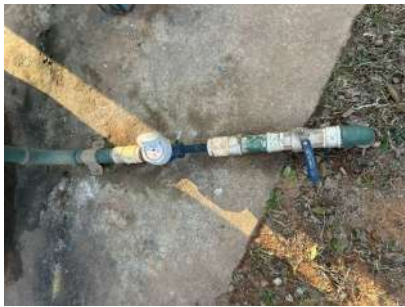
Foto 4 - Hidrômetro da entrada do reservatório Colinas II.
