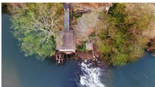
Foto 4 - Detalhe do ponto de captação, casa de bombas e demais estruturas.
