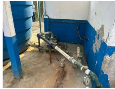
Foto 2 - Detalhe da tubulação da elevatória.
