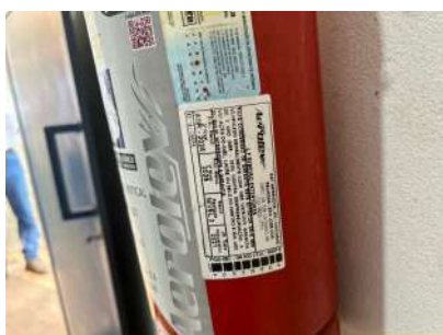
Foto 1 - Detalhe da etiqueta de controle de manutenções do extintor - dentro da validade.
