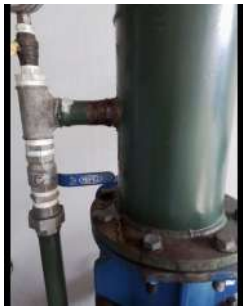
Foto 1 - Vazamento verificado em tubulação em uma das bombas da elevatória.
