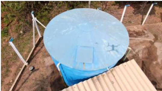
Foto 1 - Reservatório sem tubulação de ventilação.
