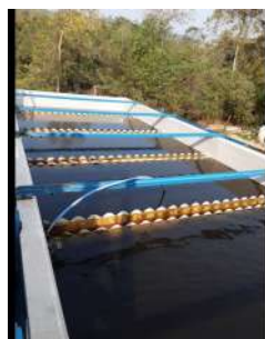
Foto 14 - Detalhe do tanque de polimento do efluente.
