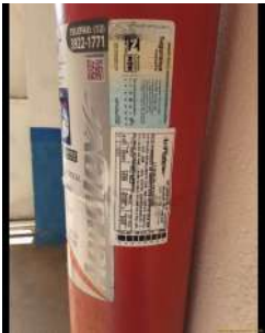
Foto 1 - Detalhe da etiqueta de controle de manutenções do extintor - dentro da validade.
