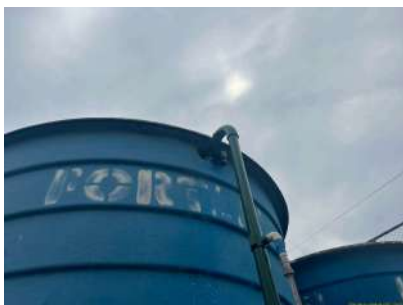
Foto 1 - Tubo extravasor à direita do tubo de alimentação do reservatório.
