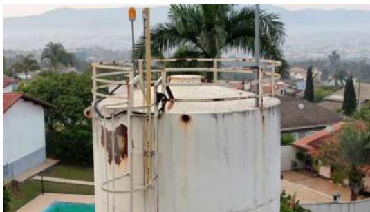
Foto 7 - Para-raios do Reservatório elevado Maranguape (metálico) em Atibaia
