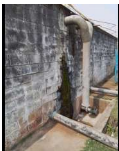
Foto 5 - Vazamentos na estrutura do Reservatório Semienterrado Maranguape em Atibaia
