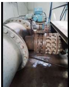
Foto 1 - Vazamentos na Captação Rio Atibaia (NOVA) em Atibaia
