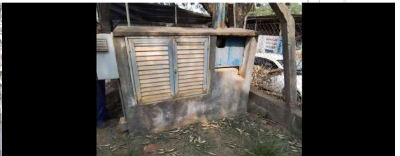
Foto 7 - Painel elétrico da Elevatória de água Brogotá em Atibaia
