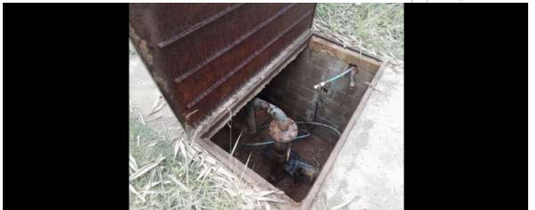
Foto 3 - Elevatória de água Brogotá em Atibaia
