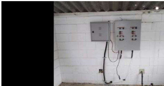
Foto 3 - Painel elétrico do Booster Maranguape em Atibaia
