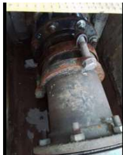
Foto 7 - Vazamento na Elevatória de água Estância Parque em Atibaia
