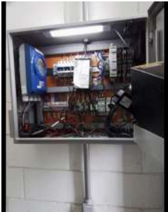
Foto 2 - Painel da Elevatória de água São Felipe em Atibaia
