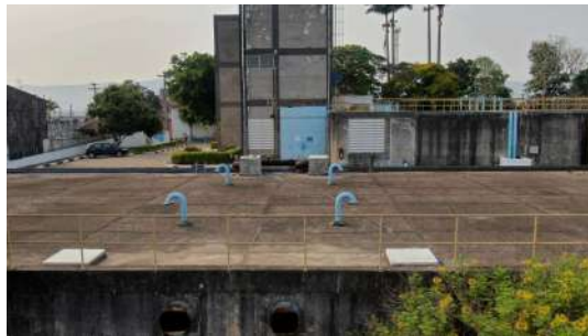
Foto 6 - Tubulações de ventilação do Reservatório Apoiado da ETA Cerejeiras em Atibaia
