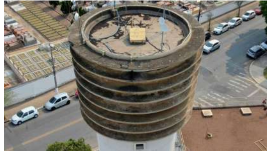
Foto 2 - Para-raios do Reservatório Central da ETA I em Atibaia
