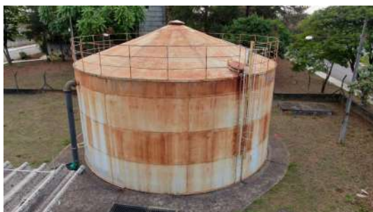
Foto 10 - Vista por drone do Reservatório Apoiado São Felipe em Atibaia
