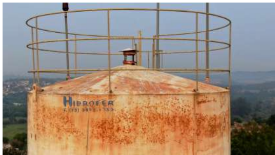
Foto 1 - Tubulação de ventilação sem telas de proteção do Reservatório Elevado São Felipe em Atibaia
