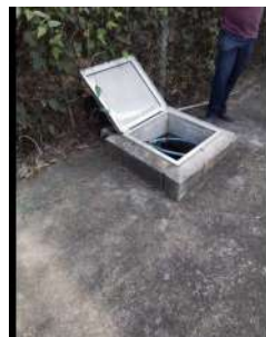
Foto 2 - Reservatório Apoiado Filipe Campioni em Atibaia
