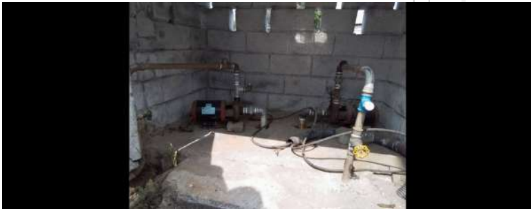
Foto 2 - Bombas da elevatória de Água Filipe Campioni em Atibaia
