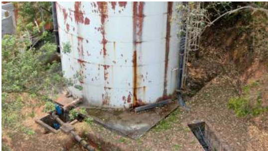
Foto 2 - Tubulações de saída e extravasão do Reservatório Bairro do Portão em Atibaia
