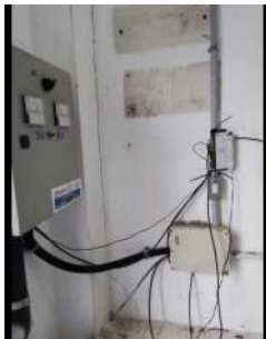
Foto 3 - Painel elétrico e medidor de nível no Reservatório Elevado Filipe Campioni em Atibaia
