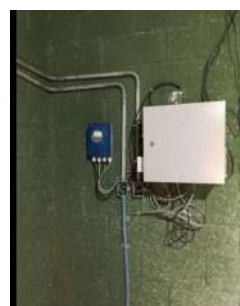
Foto 8 - Pannel elétrico da Elevatória Estância Parque em Atibaia
