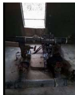
Foto 6 - Bomba da Elevatória Estância Parque em Atibaia
