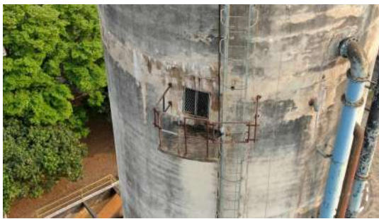
Foto 3 - Guarda-corpos inadequados do Reservatório Elevado da ETA Cerejeiras em Atibaia
