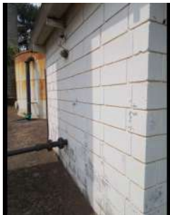
Foto 5 - Vista da Elevatória de água São Felipe em Atibaia
