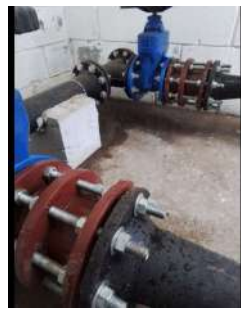
Foto 4 - Bombas da Elevatória de água São Felipe em Atibaia
