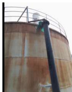
Foto 9 - Telas de proteção contra entrada de insetos do Reservatório Apoiado São Felipe em Atibaia
