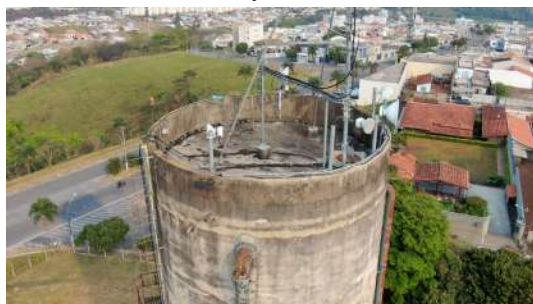
Foto 4 - Para-raios do Reservatório Elevado da ETA Cerejeiras em Atibaia
