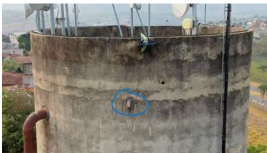
Foto 1 - Inexistência de telas de proteção na tubulação de ventilação do Reservatório Elevado da ETA Cerejeiras em Atibaia
