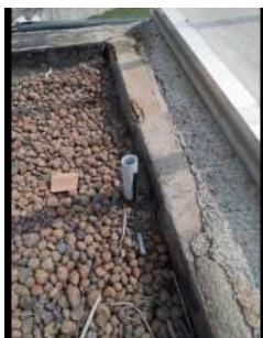
Foto 1 - Tubulação de ventilação sem tela de proteção do Reservatório Semienterrado Maranguape em Atibaia
