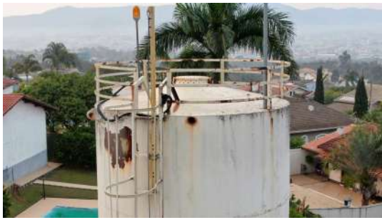
Foto 1 - Tubulação do extravasor sem tela de proteção do Reservatório elevado Maranguape (metálico) em Atibaia
