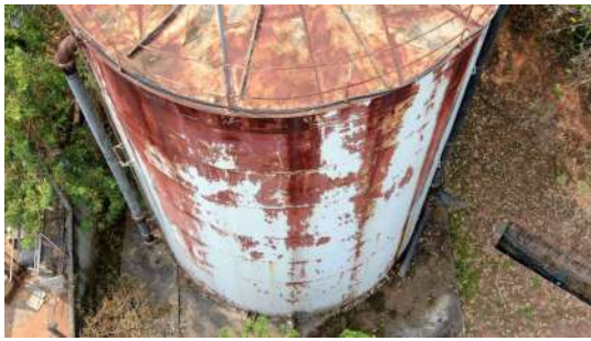
Foto 1 - Vazamentos na estrutura do Reservatório Bairro do Portão em Atibaia
