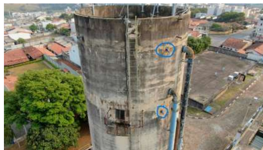
Foto 2 - Inexistência de telas de proteção na tubulação de ventilação do Reservatório Elevado da ETA Cerejeiras em Atibaia
