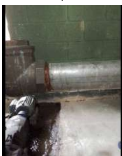
Foto 7 - Vazamento na tubulação da Bomba da Elevatória Estância Parque em Atibaia
