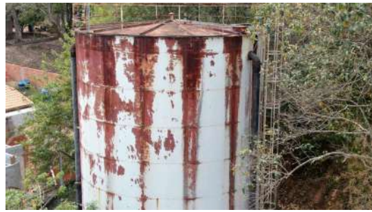
Foto 2 - Vazamentos na estrutura do Reservatório Bairro do Portão em Atibaia
