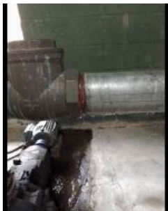
Foto 1 - Vazamento na tubulação da Bomba da Elevatória Estância Parque em Atibaia
