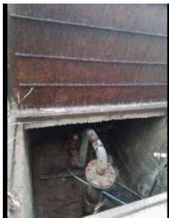
Foto 4 - Elevatória de água Brogotá em Atibaia
