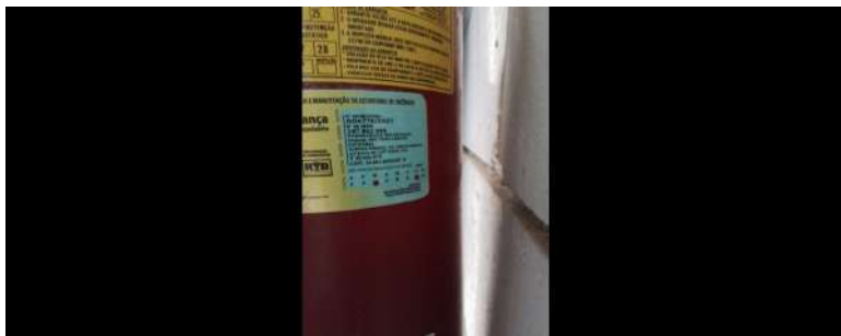
Foto 14 - Extintor de incêndio da Captação Rio Atibaia (NOVA) em Atibaia
