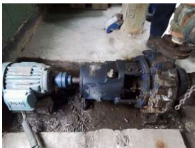
Foto 1 - Bomba da Elevatória Estância Parque em Atibaia
