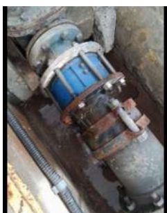
Foto 1 - Vazamento na Elevatória de água Estância Parque em Atibaia
