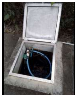
Foto 1 - Reservatório Apoiado Filipe Campioni em Atibaia
