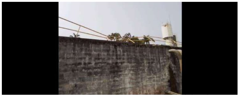
Foto 2 - Guarda-corpos em situação inadequada no Reservatório Semienterrado Maranguape em Atibaia
