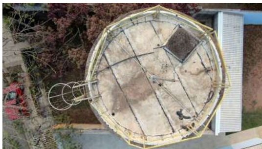
Foto 1 - Tubulações de ventilação sem telas de proteção no Reservatório Vale das Flores em Atibaia
