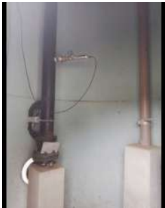
Foto 2 - Medidor de nível do Reservatório Elevado São Felipe em Atibaia
