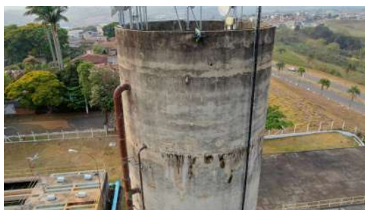
Foto 2 - Vazamentos na estrutura do Reservatório Elevado da ETA Cerejeiras em Atibaia
