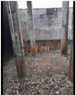
Foto 1 - Ausência de limpeza no Reservatório elevado Maranguape (concreto) em Atibaia
