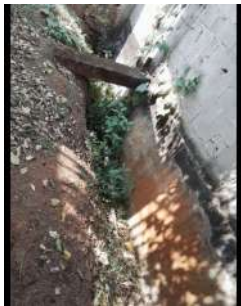
Foto 1 - Cana de extravasamento de água do Reservatório elevado Maranguape (concreto) em Atibaia
