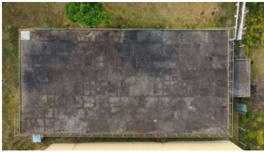
Foto 1 - Inexistência de guarda-corpo na tampa de inspeção superior do Reservatório Apoiado da ETA Cerejeiras em Atibaia
