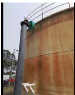
Foto 8 - Telas de proteção contra entrada de insetos do Reservatório Apoiado São Felipe em Atibaia
