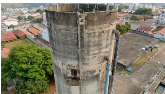
Foto 1 - Guarda-corpos inadequados do Reservatório Elevado da ETA Cerejeiras em Atibaia
