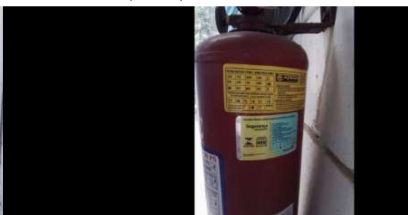
Foto 13 - Extintor de incêndio da Captação Rio Atibaia (NOVA) em Atibaia
