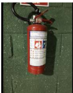
Foto 5 - Extintor de incêndio da Elevatória Estância Parque em Atibaia
