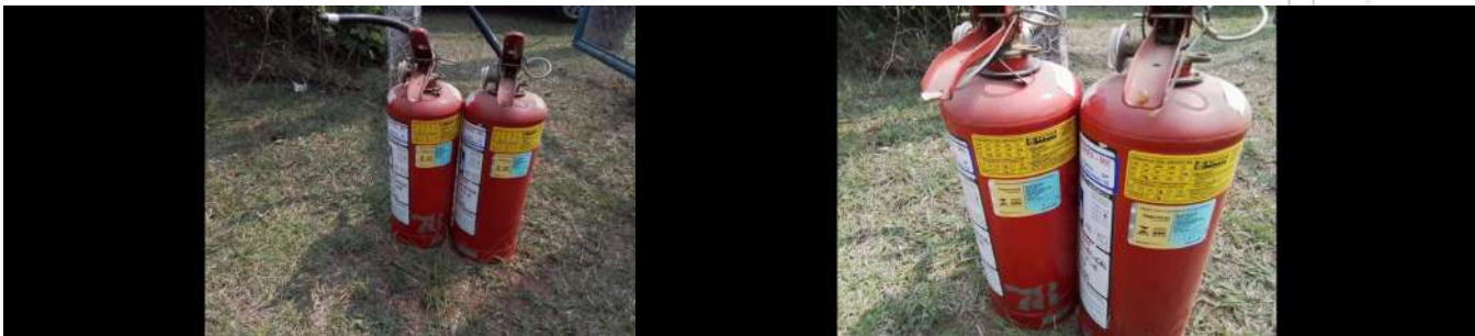
Foto 3 - Extintores de incêndio da Elevatória de Água Maranguape em Atibaia
