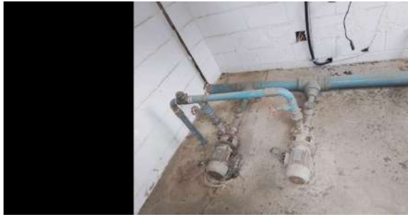
Foto 1 - Bombas do Booster Maranguape em Atibaia
