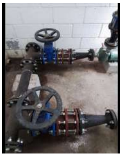
Foto 3 - Bombas da Elevatória de água São Felipe em Atibaia
