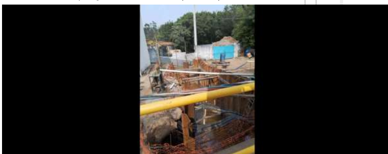
Foto 11 - Expansão da Captação Rio Atibaia (NOVA) em Atibaia
