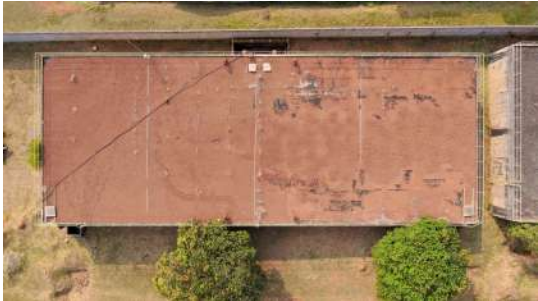
Foto 2 - Tampas de inspeção, tubulações de ventilação e guarda-corpos do Reservatório Alvinópolis em Atibaia
