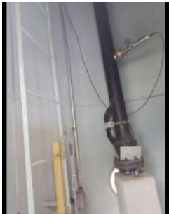
Foto 3 - Medidor de nível do Reservatório Elevado São Felipe em Atibaia
