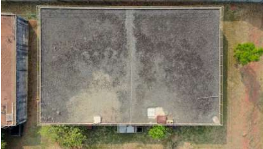
Foto 3 - Tampas de inspeção, tubulações de ventilação e guarda-corpos do Reservatório Alvinópolis em Atibaia
