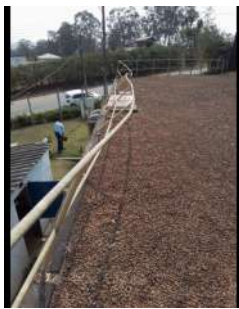
Foto 1 - Guarda-corpos em situação inadequada no Reservatório Semienterrado Maranguape em Atibaia
