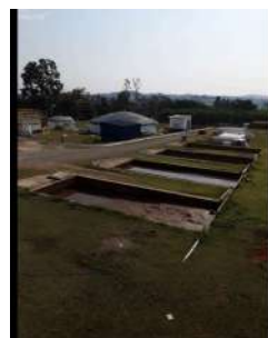
Foto 6 - Vista geral dos leitos de secagem de lodo.
