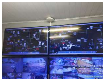
Foto 2 - Centro de Controle Operacional do sistema.
