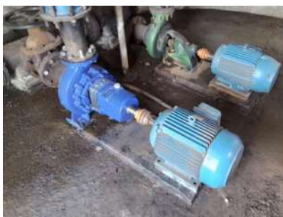
Foto 1 - Ausência de condução adequada da água de lubrificação de gaxeta.
