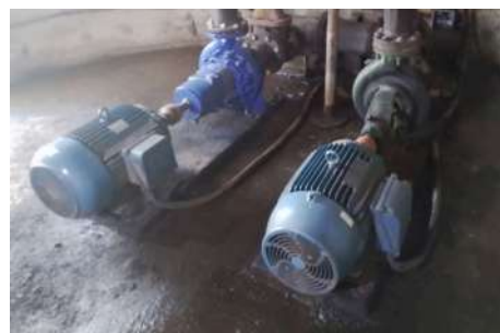
Foto 2 - Ausência de condução adequada da água de lubrificação de gaxeta.
