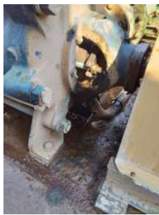
Foto 1 - Drenagem inadequada nas gaxetas do conjunto motobomba 2.
