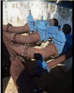
Foto 3 - Detalhe da tubulação de saída das bombas.
