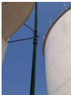
Foto 1 - Tubulação com vazamento.
