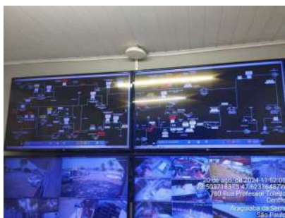
Foto 1 - Centro de Controle Operacional do sistema.
