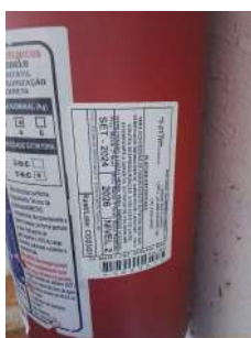
Foto 1 - Detalhe da etiqueta de controle de manutenções do extintor - dentro da validade.
