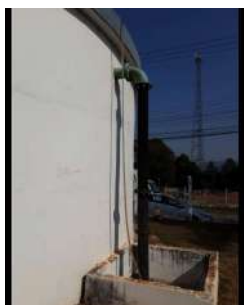
Foto 1 - Mangueira de medição de nível.
