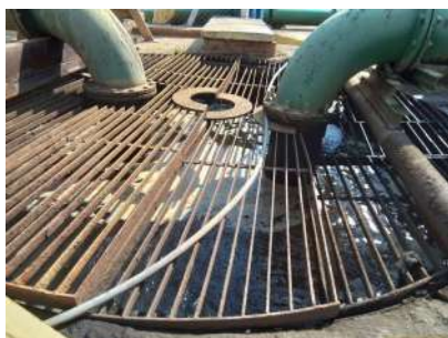
Foto 1 - Grades de proteção deterioradas.
