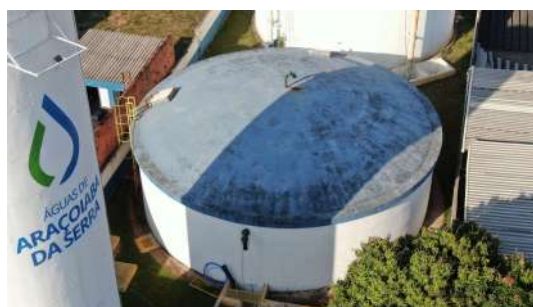
Foto 2 - Topo do reservatório semi enterrado sem guarda-corpos.
