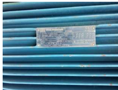
Foto 2 - Detalhe da placa de especificações técnicas do motor da bomba reserva.
