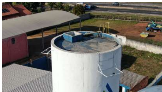
Foto 2 - Detalhe do topo do reservatório sem guarda-corpos.
