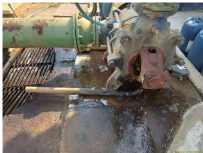
Foto 3 - Drenagem inadequada nas gaxetas do conjunto motobomba 2.
