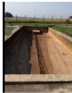
Foto 8 - Detalhe do leito de secagem 2.
