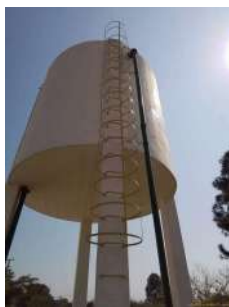
Foto 1 - Detalhe da escada e guarda-corpos para acesso ao topo do reservatório.
