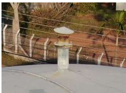
Foto 1 - Detalhe do tubo de ventilação sem tela de proteção.
