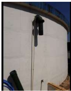
Foto 1 - Tubo extravasor do reservatório semi enterrado.
