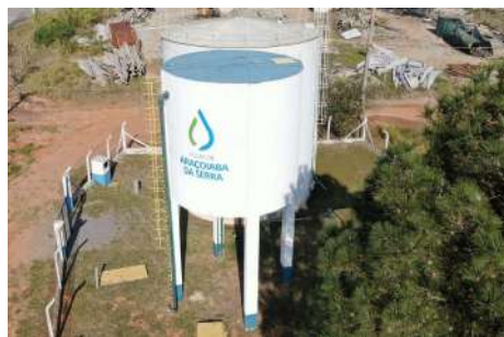
Foto 2 - Topo do reservatório sem guarda-corpos.
