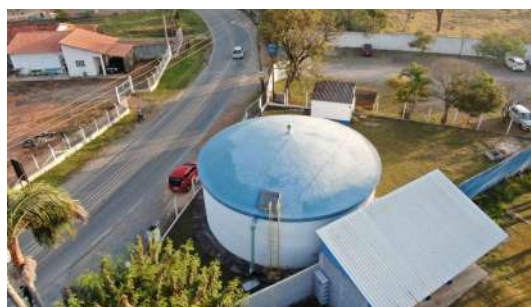
Foto 2 - Topo do reservatório sem guarda-corpos nas extremidades.
