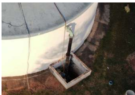
Foto 1 - Tubo extravasor próximo ao topo do reservatório.
