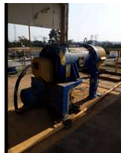
Foto 12 - Vista geral da centrífuga.
