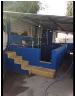
Foto 5 - Bancada de bombas dosadoras.
