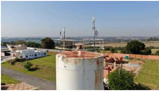
Foto 1 - Detalhe do topo do reservatório sem haste de para-raios.
