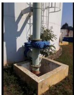
Foto 1 - Ponto com vazamento.
