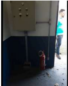
Foto 1 - Extintor de incêndio instalado no interior da edificação, ao lado do painel elétrico.
