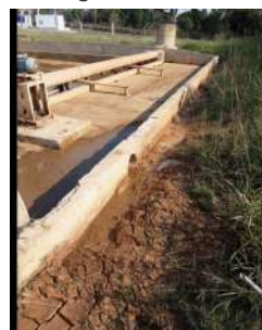
Foto 4 - Ponto com indícios de transbordamento de lodo.
