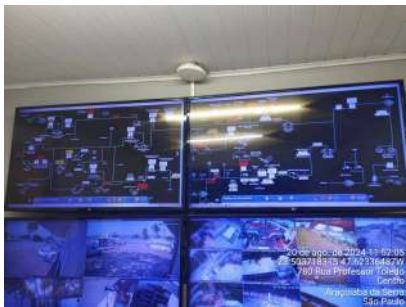
Foto 1 - Centro de Controle Operacional do sistema.
