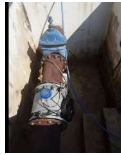
Foto 5 - Detalhe da tubulação de saída do efluente.
