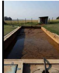
Foto 10 - Detalhe do leito de secagem 4.
