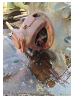
Foto 2 - Drenagem inadequada nas gaxetas do conjunto motobomba 2.
