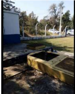
Foto 3 - Detalhe do poço de bombeamento do efluente.
