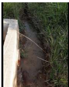
Foto 5 - Ponto com indícios de transbordamento de lodo.
