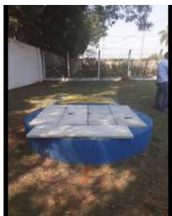
Foto 5 - Detalhe do poço de bombeamento do efluente, protegido com placas de concreto.
