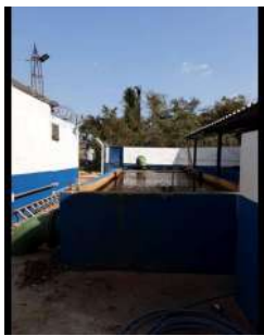
Foto 3 - Tanque de entrada da água bruta para dosagem de produtos químicos.
