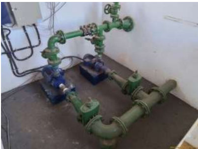
Foto 4 - Tubulação e bombas da elevatória.
