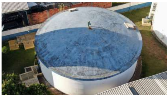
Foto 1 - Tubo de ventilação no topo do reservatório semi enterrado.
