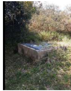
Foto 2 - Caixa de proteção da válvula da adutora.
