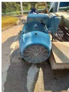
Foto 1 - Conjunto moto bomba reserva.
