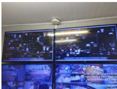
Foto 1 - Centro de Controle Operacional do sistema.
