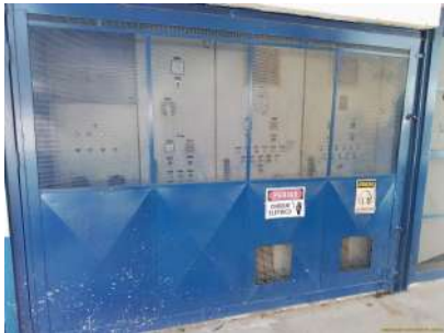
Foto 2 - Painel elétrico da estação elevatória.
