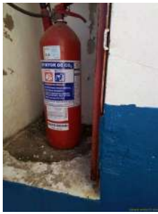
Foto 1 - Extintor de incêndio instalado próximo ao portão de entrada.
