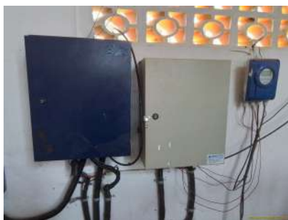
Foto 5 - Detalhe dos painéis elétricos no interior da edificação.
