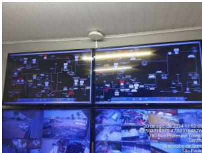
Foto 1 - Centro de Controle Operacional do sistema.
