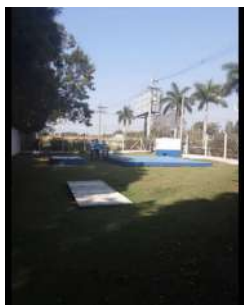
Foto 3 - Vista geral da estação elevatória.
