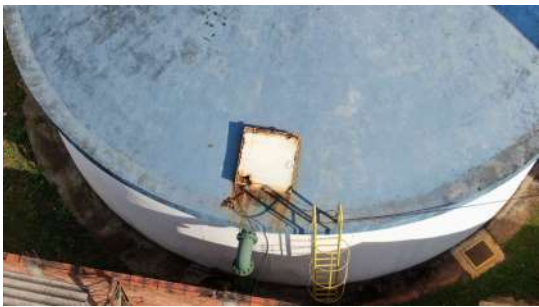
Foto 1 - Detalhe da tampa de inspeção próxima à escada - apresenta sinais de deterioração.
