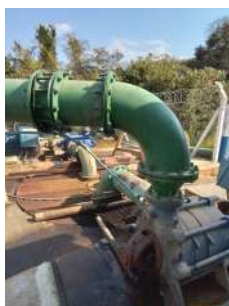
Foto 1 - Ponto com vazamento na tubulação de recalque.
