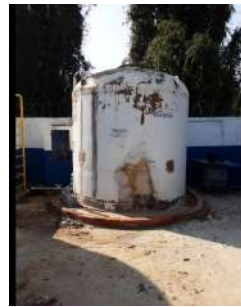
Foto 6 - Tanque de armazenamento de Hipoclorito de Sódio.
