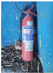
Foto 1 - Extintor de incêndio instalado próximo aos painéis elétricos da estação.
