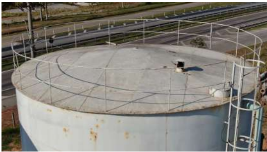
Foto 1 - Detalhe da tubulação de ventilação no topo do reservatório.
