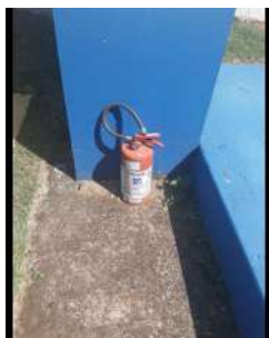
Foto 1 - Extintor de incêndio instalado próximo aos painéis elétricos.
