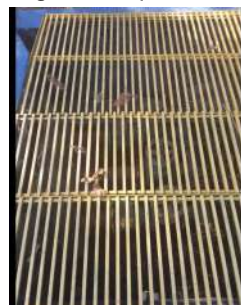
Foto 6 - Detalhe dos registros da tubulação de saída do efluente bombeado, protegidos com grades.
