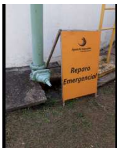
Foto 1 - Ponto com necessidade de reparo, localizado próximo à parede do reservatório.
