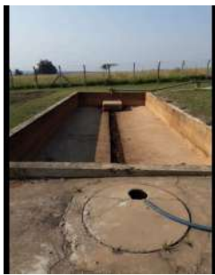
Foto 7 - Detalhe do leito de secagem 1.
