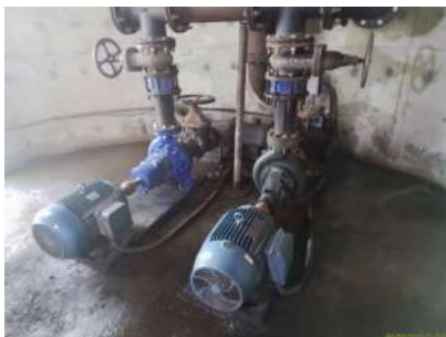
Foto 1 - Conjuntos de moto bomba da elevatória, uma em funcionamento e a outra como reserva.
