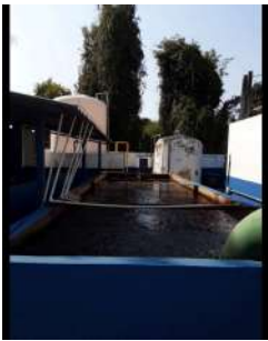
Foto 2 - Tanque de entrada da água bruta para dosagem de produtos químicos.
