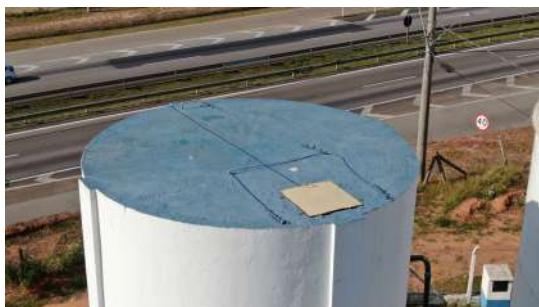
Foto 1 - Não há para-raios no reservatório elevado.
