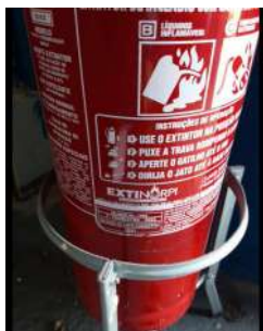
Foto 1 - Detalhe da etiqueta de controle de manutenções do extintor - a validade da carga está vencida desde o 1º trimestre de 2023.
