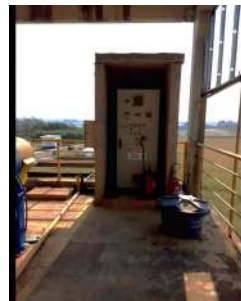
Foto 13 - Painel elétrico da centrífuga.
