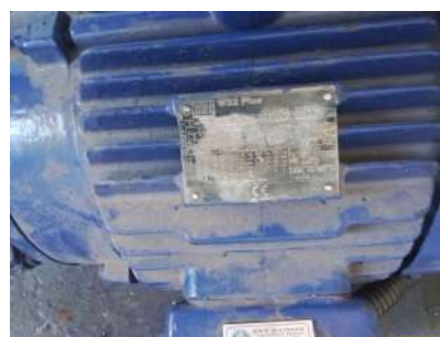
Foto 2 - Detalhe da placa de identificação da bomba reserva.
