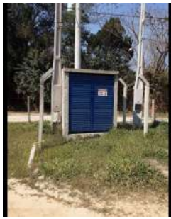
Foto 1 - Painel elétrico da captação.
