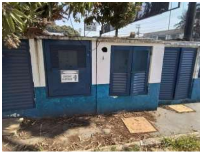
Foto 3 - Painéis elétricos da estação.
