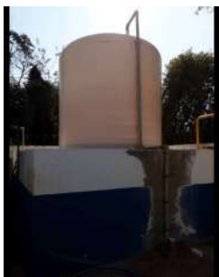
Foto 7 - Tanque de armazenamento de Hipoclorito de Sódio.
