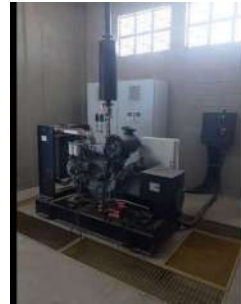
Foto 6 - Gerador e painéis elétricos no interior da edificação.
