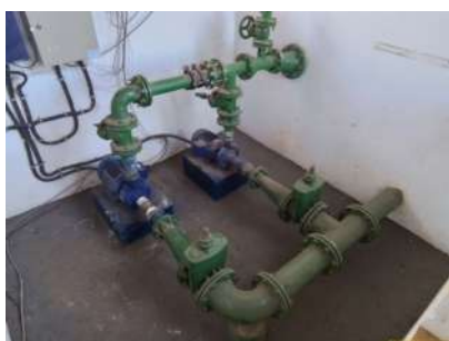
Foto 1 - Conjunto de moto bombas da elevatória, uma em funcionamento e a outra como reserva.
