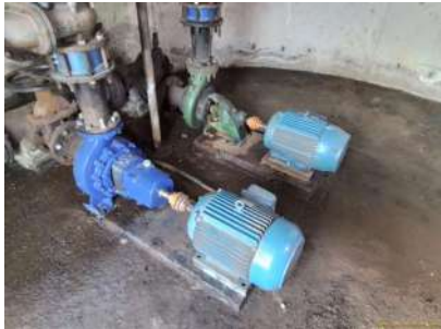
Foto 2 - Vista geral da estação elevatória.
