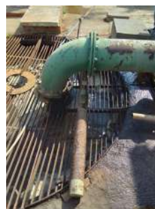
Foto 2 - Grades de proteção deterioradas.
