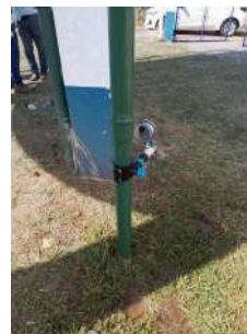
Foto 2 - Água empoçada na base da tubulação com vazamento.
