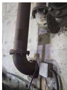
Foto 2 - Detalhe da tubulação com vazamento.
