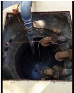
Foto 1 - Detalhe do poço de bombeamento sem cobertura ou proteção.
