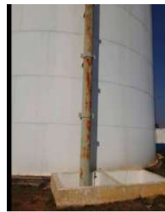
Foto 2 - Tubo extravasor do reservatório apoiado.
