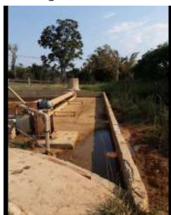
Foto 3 - Ponto com indícios de transbordamento de lodo.
