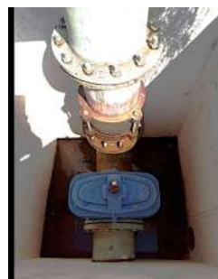
Foto 2 - Detalhe do vazamento na flange da tubulação.
