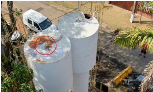
Foto 1 - Ventilação em um dos reservatórios.
