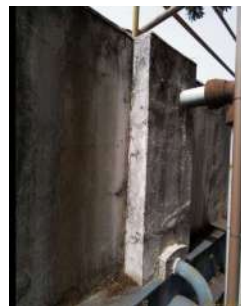
Foto 3 - Marcas de infiltração no exterior do reservatório.
