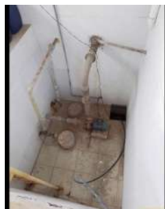
Foto 2 - Apenas uma bomba instalada.
