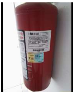
Foto 1 - Manutenção do extintor.
