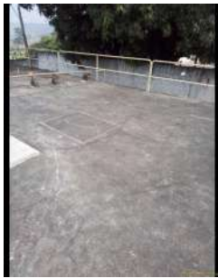
Foto 1 - Laje de cobertura do reservatório: diversas fissuras e indícios de que a camada superficial apresenta patologias. Recomenda-se a realização de estudos para verificar a integridade da laje e da impermeabilização.
