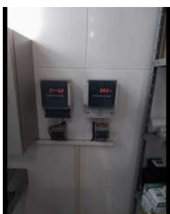
Foto 1 - Monitoramento de nível dos reservatórios da ETA.
