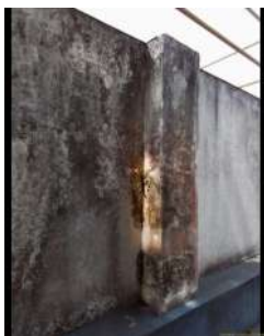
Foto 4 - Marcas de infiltração no exterior do reservatório.
