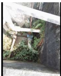
Foto 1 - Caixa onde é necessário realizar limpeza.
