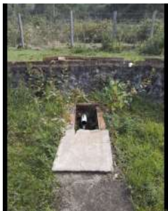
Foto 1 - Captação superficial de nascente.
