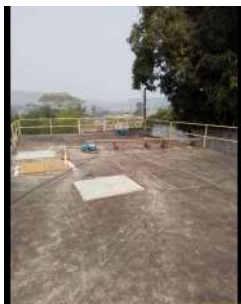
Foto 4 - Visão do sistema de bombeamento sobre a cobertura do reservatório retangular.
