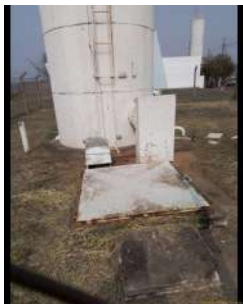
Foto 1 - Visão do conjunto motobomba que abastece o reservatório Jd. Colina
