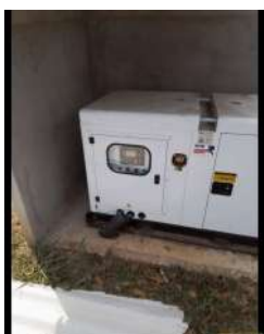
Foto 10 - Novo gerador da ETA.
