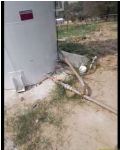
Foto 2 - Alimentação e saída do reservatório.
