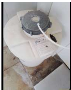
Foto 3 - Dosagem de cloro.
