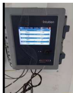
Foto 6 - Display do sistema de monitoramento digital dos parâmetros. Os funcionários informaram que para o parâmetro cor aparente, o equipamento está apresentando dados inconsistentes.
