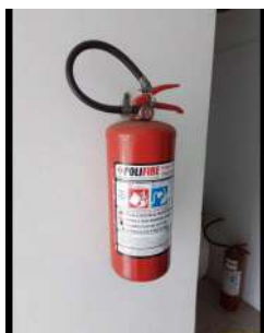
Foto 1 - Extintor na ETA.
