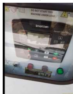
Foto 11 - Novo gerador da ETA.
