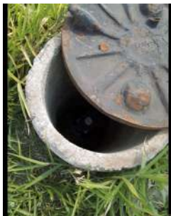
Foto 2 - Macromedidor da captação.
