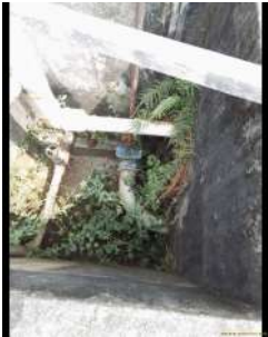
Foto 3 - Caixa com tubulação de saída do reservatório.
