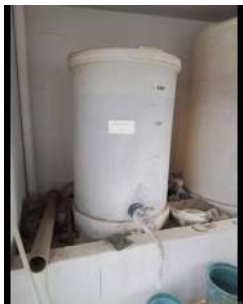
Foto 1 - Armazenamento de flúor.
