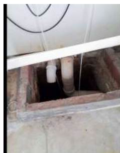
Foto 2 - Dosagem de cloro no tanque de contato.
