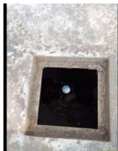
Foto 5 - Medidor de vazão na saída da ETA.
