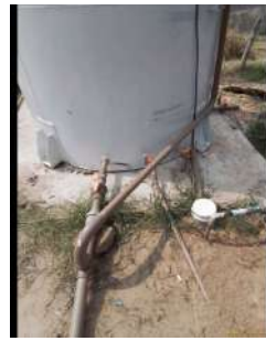
Foto 4 - Tubulações de entrada e saída do reservatório.
