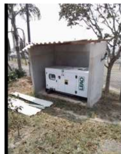
Foto 9 - Novo gerador da ETA.
