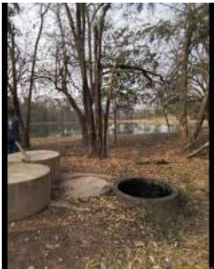
Foto 1 - Chegada do efluente na ETE.
