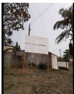
Foto 1 - Placa está ilegível.
