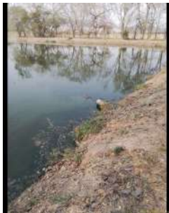
Foto 4 - Entrada do efluente na lagoa de estabilização.
