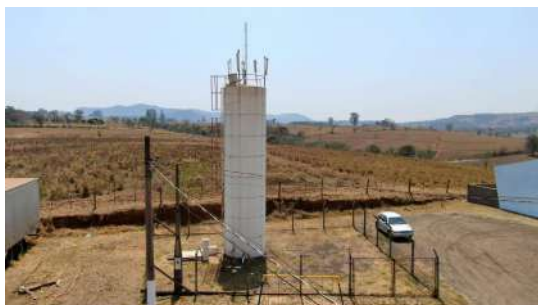
Foto 3 - Para-raios na cobertura.
