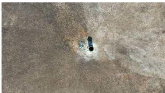
Foto 3 - Tubo de ventilação com tela de proteção.
