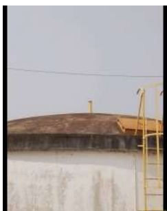
Foto 1 - Tela de proteção no tubo de ventilação.
