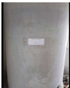
Foto 1 - Tanque para armazenamento de cloro.
