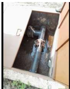
Foto 3 - Tubulação que encaminha a água bruta para o filtro ascendente ou para a pré-filtração (filtro dinâmico), após passar pelo medidor na entrada.
