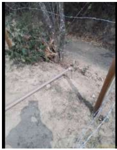
Foto 3 - Tubulação de saída do reservatório.
