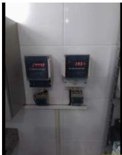
Foto 1 - Medidores de nível dos reservatórios da ETA.
