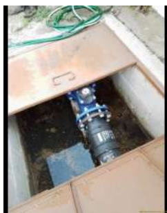
Foto 1 - Medidor de vazão na entrada da ETA.
