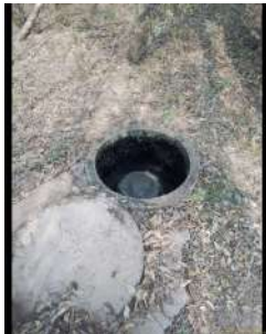
Foto 2 - Chegada do efluente na ETE.
