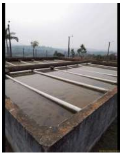
Foto 5 - Filtro ascendente da ETA.
