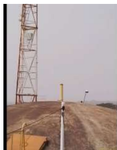
Foto 2 - Tela de proteção no tubo de ventilação.
