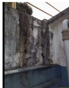
Foto 5 - Marcas de infiltração no exterior do reservatório.
