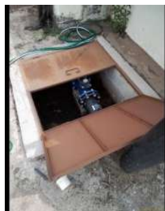
Foto 4 - Medidor de vazão na entrada da ETA.
