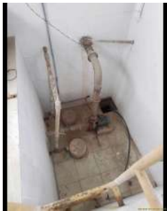
Foto 1 - Bomba que recalca água tratada para os reservatórios situados na ETA.
