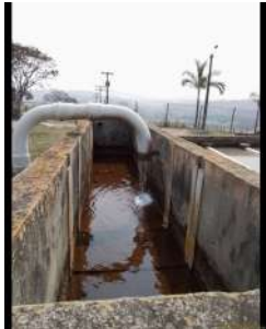
Foto 4 - Entrada de água no filtro ascendente, vindo do filtro dinâmico.
