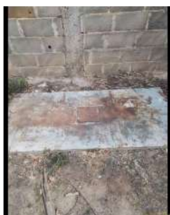
Foto 6 - Caixa que abriga o medidor de vazão na saída da ETA.
