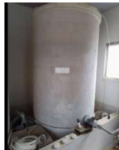
Foto 2 - Armazenamento de cloro.
