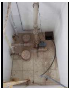
Foto 1 - Apenas uma bomba instalada.
