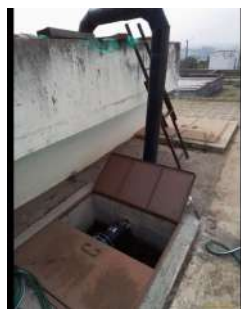
Foto 2 - Abrigo do medidor de vazão na entrada da ETA.
