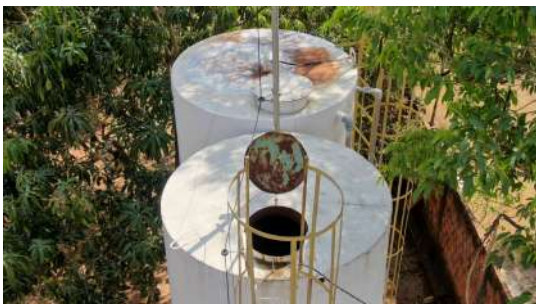
Foto 1 - Tampas em ambos os reservatórios, sendo que uma estava aberta pelo fato de o reservatório ter sido esvaziado para substituição de redes.
