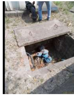
Foto 4 - Válvula controladora de nível.
