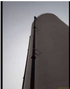
Foto 4 - Tubulação de alimentação.
