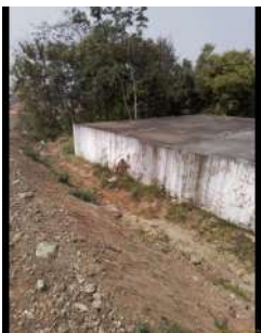
Foto 1 - Infiltrações verificadas externamente.
