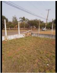
Foto 1 - Trecho da cerca e mureta necessitando de manutenção.
