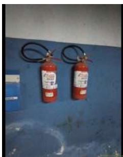
Foto 1 - Extintor de incêndio na casa de bombas.
