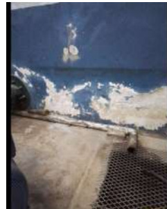
Foto 9 - Tubo que drena a água de lubrificação de todas as bombas.
