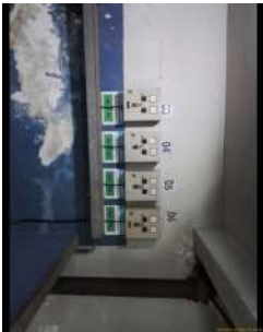
Foto 2 - Paineis das bombas da elevatória.
