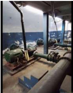
Foto 2 - Outros dois conjuntos motobomba da elevatória.
