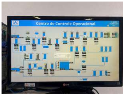
Foto 5 - CCO do DAAE exibindo o sistema de telemetria,
