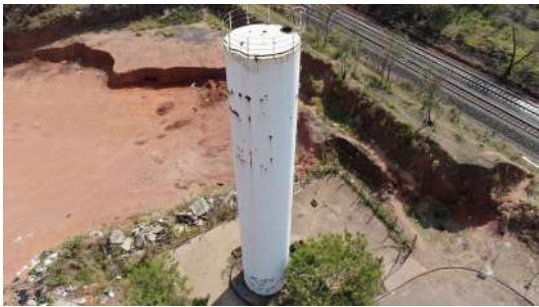
Foto 1 - Observa-se a existência de portão e mourões de concreto na área, porém não é possível avaliar se a cerca está adequada em todo o perímetro.
