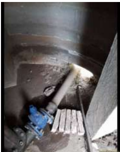
Foto 3 - Tubulação que funciona ora como alimentação, ora como saída do reservatório.
