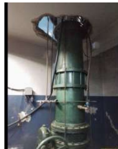
Foto 11 - Recalque da elevatória.
