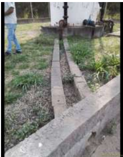
Foto 2 - Canaleta para coletar água do extravasor.
