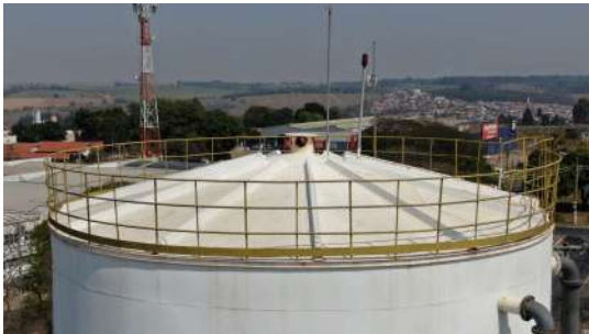
Foto 1 - É necessário proteger as aberturas da chaminé de ventilação com telas de proteção.
