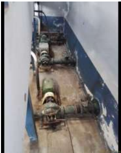
Foto 1 - Interior da elevatória da ETA I.
