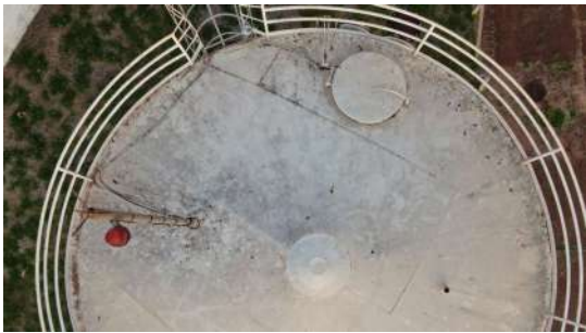
Foto 3 - Para-raios na cobertura do reservatório.
