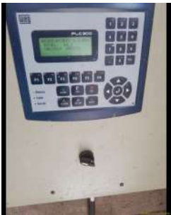
Foto 1 - Display do sistema de telemetria, situado na EEAT Nova Rio Claro, exibindo o nível do reservatório elevado.
