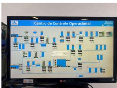
Foto 5 - CCO do DAAE exibindo o sistema de telemetria.
