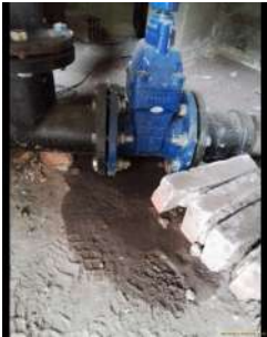
Foto 2 - Vazamento verificado em flange da tubulação na câmara inferior.
