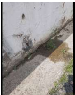
Foto 3 - Infiltrações verificadas externamente.
