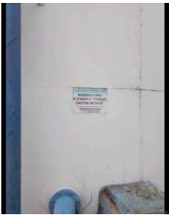
Foto 1 - Placa de identificação do reservatório.
