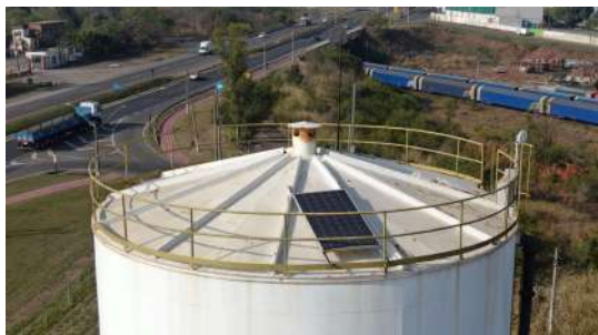
Foto 1 - Para-raios na cobertura do reservatório.
