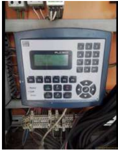
Foto 3 - Nível do reservatório visto no display do sistema de telemetria.
