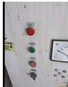
Foto 2 - Painel de comando das bombas.
