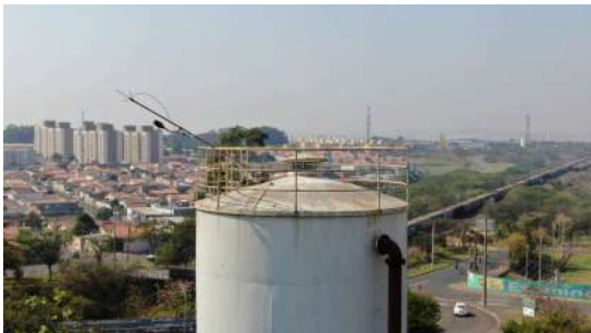
Foto 1 - Deve-se adequar a haste do para-raios.
