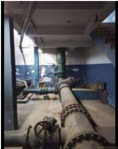
Foto 3 - Interior da elevatória.
