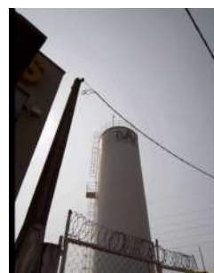
Foto 2 - Para-raios na cobertura do reservatório. Contudo, deve realizar manutenção na haste.
