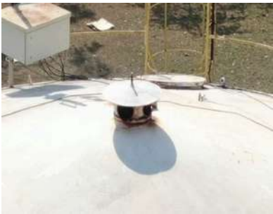
Foto 1 - Ausência de telas de proteção na chaminé de ventilação do reservatório.
