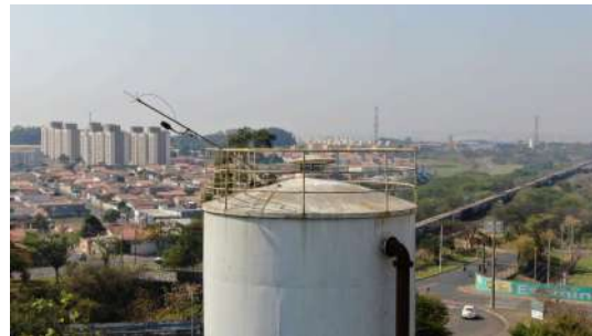
Foto 2 - Para-raios na cobertura do reservatório. Contudo, deve realizar manutenção na haste.
