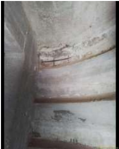
Foto 1 - Pontos de armadura exposta no interior do reservatório.
