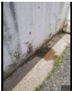
Foto 2 - Infiltrações verificadas externamente.
