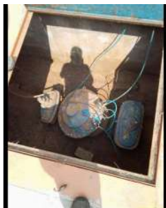
Foto 3 - Válvula controladora de nível na entrada do reservatório.
