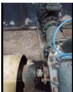
Foto 3 - Tubulação para drenar a água de lubrificação de gaxetas.
