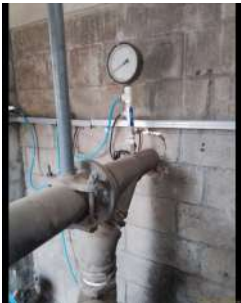
Foto 2 - Recalque da elevatória e manômetro.
