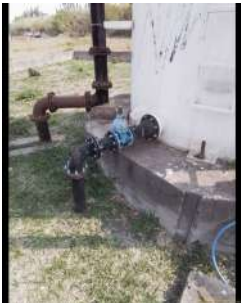
Foto 2 - Tubulações de entrada e saída do elevatório.
