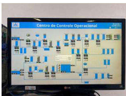
Foto 1 - CCO do DAAE exibindo o sistema de telemetria.
