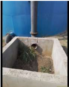
Foto 1 - Caixa coletora do extravasor.
