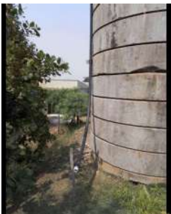
Foto 1 - Mangueira acoplada para extravasar o reservatório.
