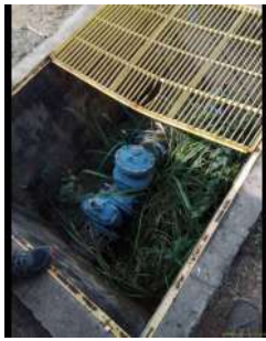
Foto 5 - Válvula controladora de nível do reservatório.
