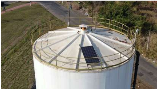
Foto 1 - É necessário vedar as aberturas da chaminé de ventilação com telas.
