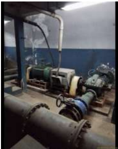
Foto 1 - Dois conjuntos motobomba na elevatória.
