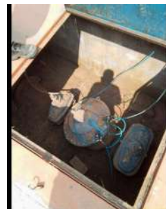
Foto 4 - Válvula controladora de nível na entrada do reservatório.
