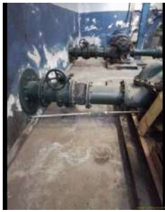
Foto 7 - Tubulação para drenar a água de lubrificação de gaxetas.
