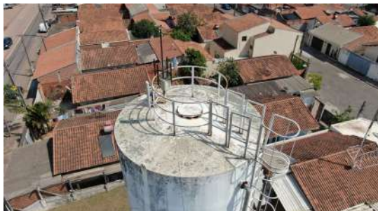
Foto 1 - Ausência de para-raios.
