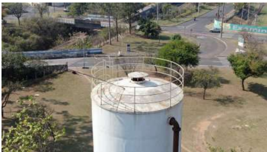
Foto 1 - Ausência de tela de proteção nas aberturas da chaminé de ventilação.
