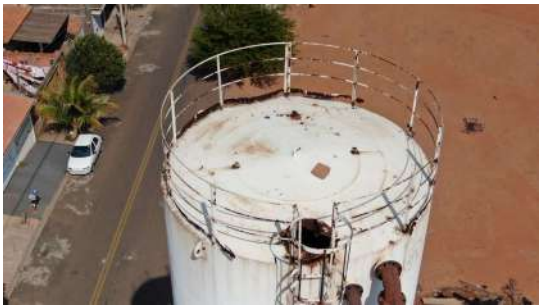
Foto 1 - Ausência de para-raios.
