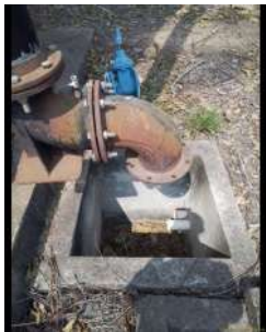
Foto 3 - Caixa coletora do extravasor.
