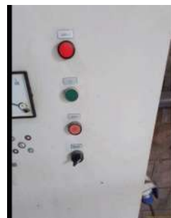
Foto 3 - Painel de comando das bombas.
