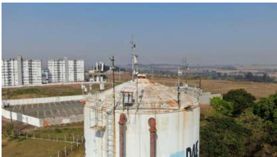
Foto 1 - Para-raios na cobertura.
