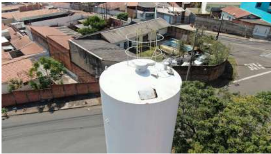
Foto 1 - Ausência de para-raios.
