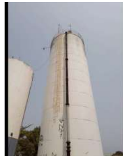
Foto 4 - Tubo de alimentação do reservatório.
