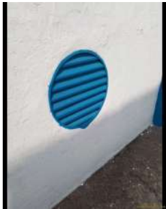
Foto 1 - Ventilação de um dos reservatórios.
