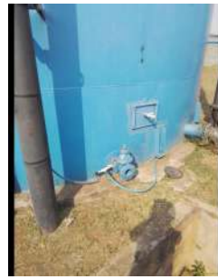
Foto 6 - Sensor de nível do sistema de telemetria
