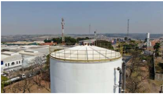
Foto 1 - Para-raios na cobertura do reservatório.
