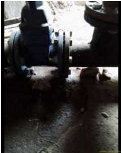
Foto 1 - Vazamento verificado em flange da tubulação na câmara inferior.
