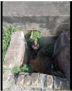
Foto 1 - Extravasor de uma das câmaras do reservatório.
