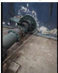
Foto 5 - Tubulação para drenar a água de lubrificação de gaxetas e tubo que coleta as contribuições de todas as bombas.
