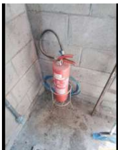
Foto 1 - Extintor na elevatória.
