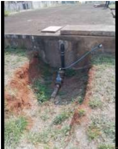
Foto 2 - Alimentação do reservatório.
