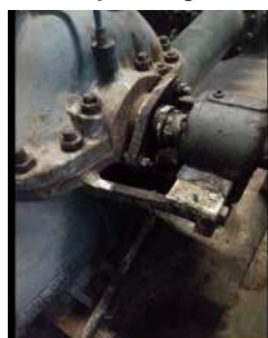
Foto 6 - Detalhe da lubrificação de gaxeta de bomba em operação e tubo para drenar.
