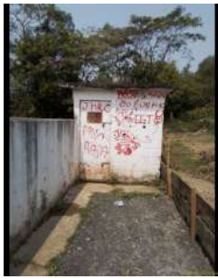
Foto 1 - Ausência de cerca no perímetro da elevatória e reservatório.
