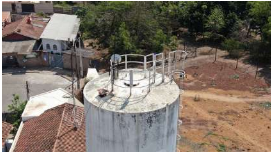
Foto 1 - Chaminés de ventilação na cobertura do reservatório.
