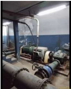
Foto 5 - Interior da elevatória.
