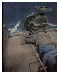
Foto 2 - Tubulação para drenar a água de lubrificação de gaxetas.
