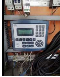
Foto 2 - Display exibindo configuração da válvula de controle da entrada do reservatório.
