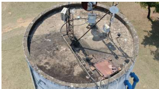
Foto 1 - Tampa de inspeção bastante corroída.
