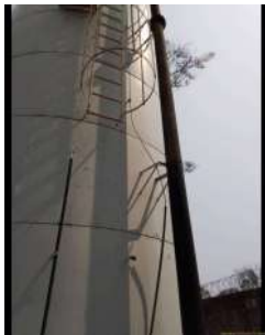
Foto 1 - Aterramento de para-raios.
