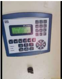
Foto 1 - Display do sistema de telemetria, situado no EEAT Nova Rio Claro, exibindo o nível do reservatório apoiado (semienterrado).
