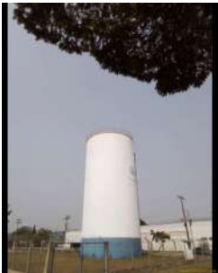
Foto 1 - Para-raios na cobertura do reservatório.
