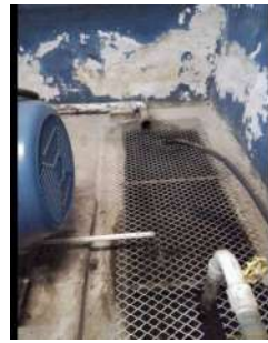
Foto 8 - Caixa coletora da água de lubrificação.
