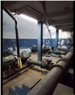
Foto 4 - Interior da elevatória.
