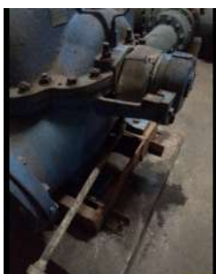
Foto 1 - Tubulação para drenar a água de lubrificação de gaxetas.
