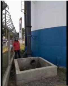
Foto 2 - Caixa coletora do extravasor.
