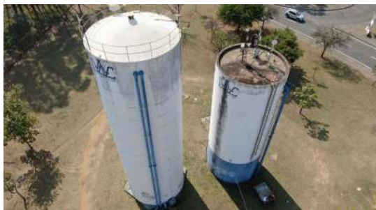
Foto 1 - Ausência de cerca no perímetro da área.
