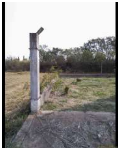
Foto 1 - Ausência de cerca ou muro.
