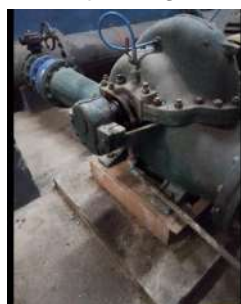
Foto 4 - Tubulação para drenar a água de lubrificação de gaxetas.
