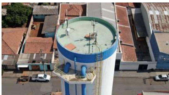
Foto 1 - Para-raios na cobertura do reservatório.
