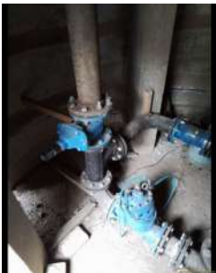
Foto 4 - Tubulação que funciona ora como alimentação, ora como saída do reservatório.
