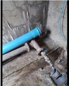
Foto 3 - Tubulação de sucção da elevatória, proveniente do reservatório semienterrado.
