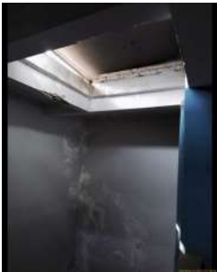
Foto 3 - Alçapão para içamento das bombas.
