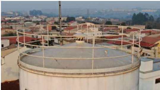
Foto 1 - Ausência de telas de proteção nas aberturas da chaminé de ventilação.
