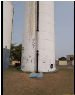
Foto 3 - Tubo de alimentação do reservatório.
