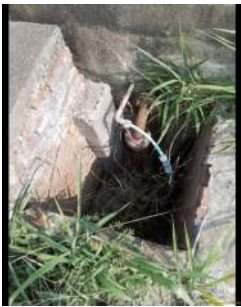
Foto 2 - Extravasor de uma das câmaras do reservatório.
