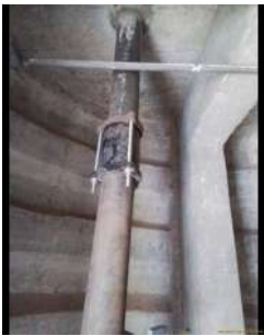
Foto 5 - Tubulação que funciona ora como alimentação, ora como saída do reservatório.
