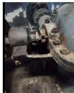
Foto 12 - Detalhe da lubrificação de gaxeta de bomba em operação e tubo para drenar.
