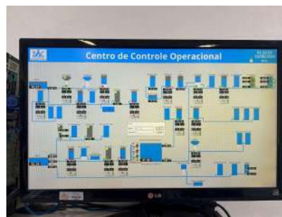
Foto 2 - CCO do DAAE exibindo o sistema de telemetria.
