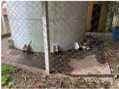
Foto 3 - Vazamento na base do reservatório
