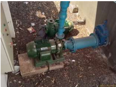
Foto 4 - Bombas da elevatória
