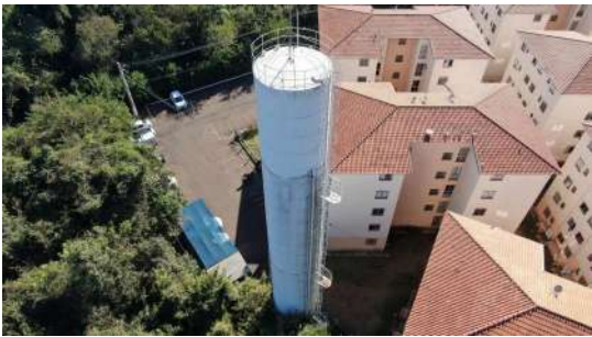
Foto 1 - Tubulação extravasora sem tela de proteção
