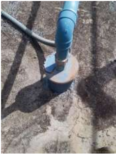
Foto 1 - Ausência de tubo de medição de nível
