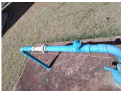
Foto 1 - Cavalete sem macromedidor
