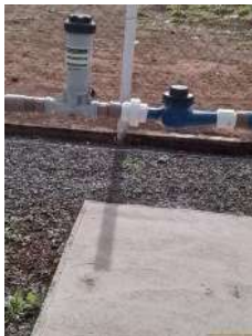
Foto 5 - Dosador de cloro e flúor e macromedidor
