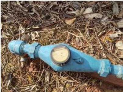
Foto 2 - Macromedidor de vazão
