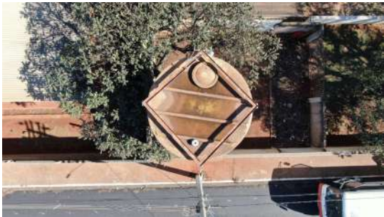
Foto 1 - Tubulação de ventilação sem tela de proteção
