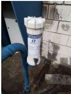
Foto 1 - Suporte para cloração/fluoretação instalado, mas não há aplicação
