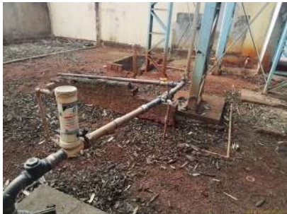
Foto 2 - Cavalete do poço
