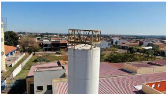
Foto 1 - Reservatório sem para-raios
