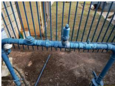
Foto 1 - Cavalete sem macromedidor
