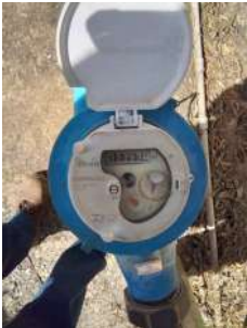
Foto 4 - Macromedidor de vazão
