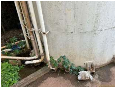
Foto 1 - Vazamento na base do reservatório
