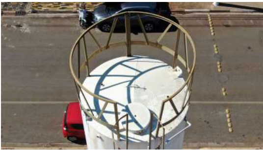
Foto 2 - Tubulações de ventilação sem tela de proteção, e sem proteção contra a entrada de água de chuva
