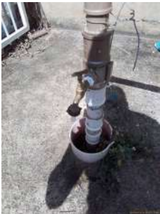
Foto 6 - Torneira para coleta de água bruta
