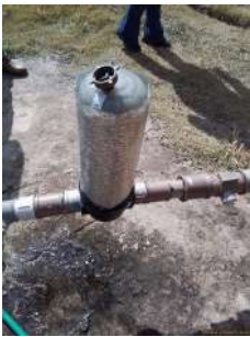
Foto 5 - Dosador de cloro e flúor
