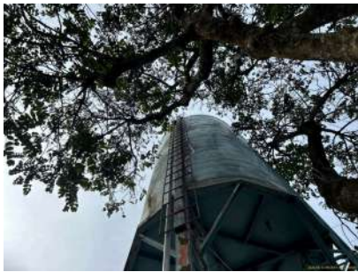
Foto 1 - Sacolas amarradas em tubulação do reservatório
