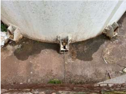
Foto 3 - Aterramento do reservatório metálico
