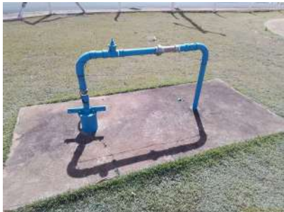
Foto 1 - Cavalete do poço
