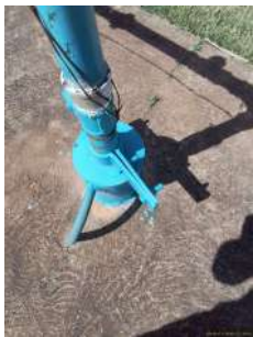
Foto 1 - Ausência de tubo de medição de nível
