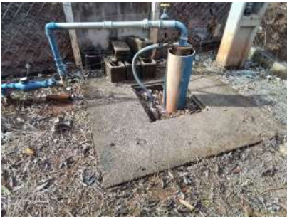
Foto 4 - Cavalete do poço
