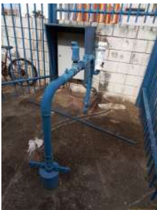
Foto 4 - Cavalete do poço
