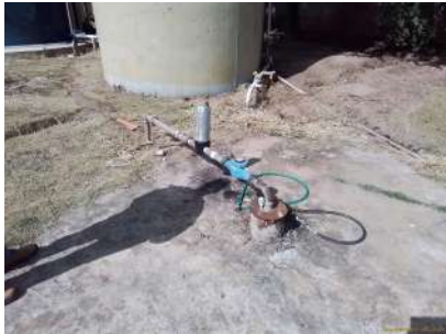
Foto 1 - Cavalete do poço
