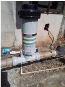
Foto 5 - Dosador de cloro e flúor
