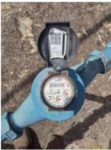
Foto 3 - Macromedidor de vazão
