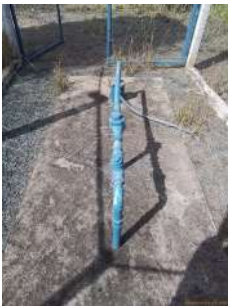
Foto 4 - Cavalete do poço
