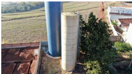
Foto 1 - Reservatório sem para-raios
