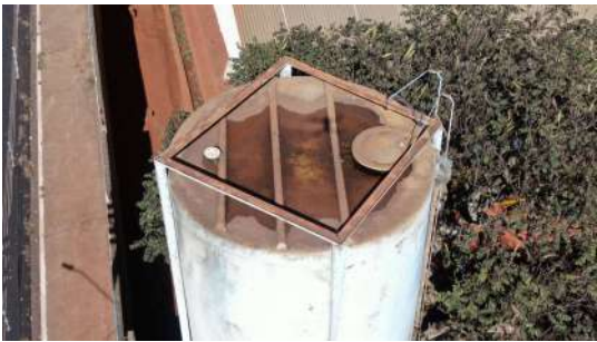
Foto 2 - Sacolas amarradas em tubulação do reservatório (à direita na imagem)
