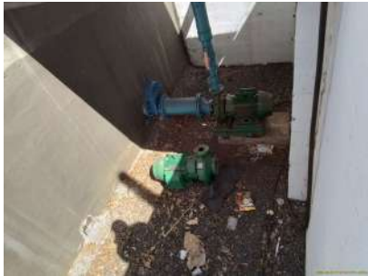
Foto 1 - Bombas da elevatória
