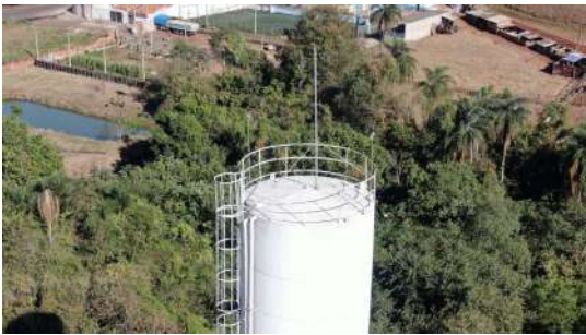
Foto 6 - Vista aérea do reservatório, com para-raios
