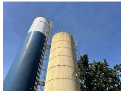
Foto 4 - Vista geral do reservatório de 300 m³ à esquerda, e do reservatório de 70 m³ à direita
