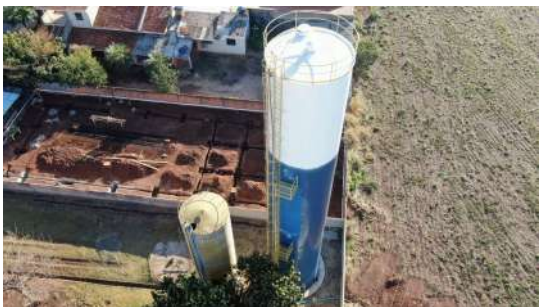
Foto 1 - Reservatório à esquerda sem tubulação de ventilação
