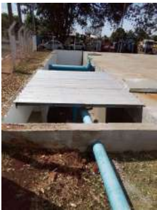
Foto 3 - Recalque da elevatória
