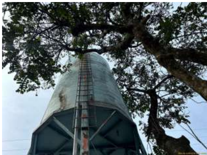
Foto 1 - Não é possível identificar o nível a partir da mangueira existente
