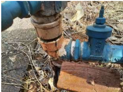
Foto 1 - Vazamento no registro
