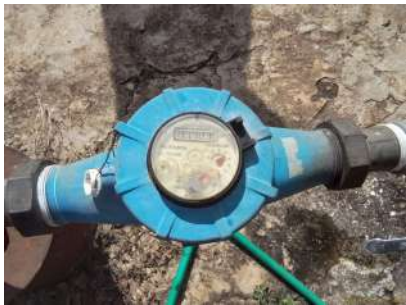
Foto 3 - Macromedidor de vazão
