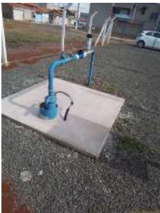
Foto 6 - Cavalete do poço
