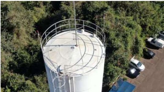
Foto 1 - Reservatório sem tubulação de ventilação
