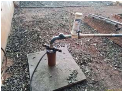
Foto 1 - Cavalete do poço
