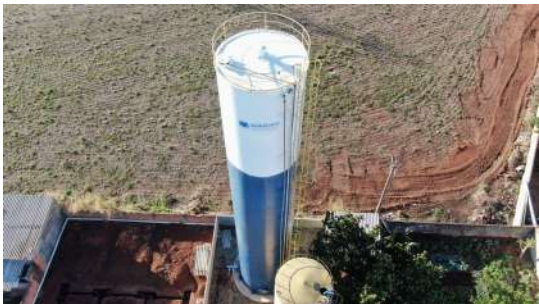
Foto 1 - Tubo extravasor sendo utilizado para outros usos no reservatório
