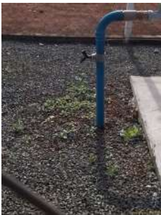
Foto 4 - Torneira para coleta de água bruta
