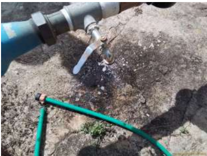
Foto 4 - Torneira para coleta de água bruta
