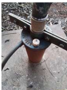
Foto 1 - Abertura para o tubo, mas conforme relatório 166/2023 não há tubulação instalada.
