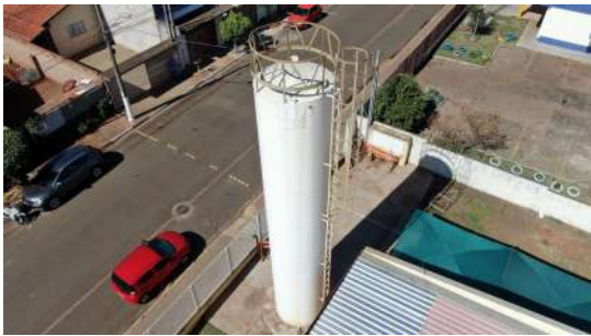
Foto 1 - Extravaso sem tela de proteção
