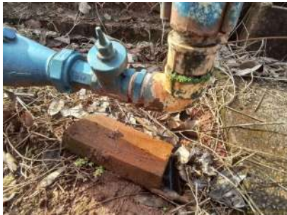
Foto 2 - Vazamento no registro
