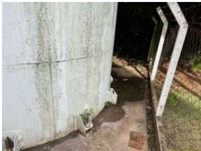
Foto 2 - Vazamento na base do reservatório
