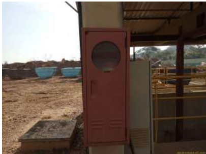
Foto 5 - Extintor de incêndio
