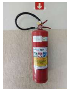
Foto 2 - Extintor de incêndio
