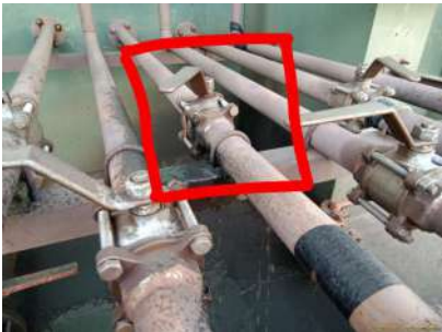
Foto 2 - Detalhe do vazamento registro de recirculação de lodo
