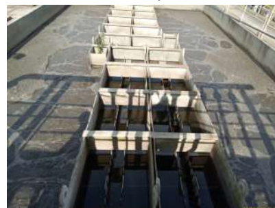
Foto 6 - Saída esgoto tratado na canaleta
