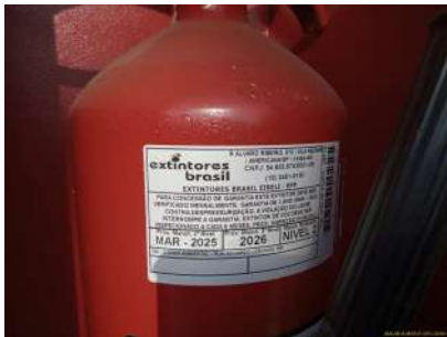
Foto 1 - Extintor dentro da validade
