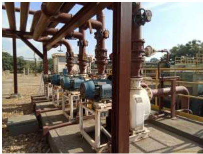
Foto 3 - Conjuntos motobomba em operação e reserva
