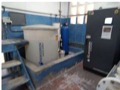
Foto 1 - Gerador de cloro
