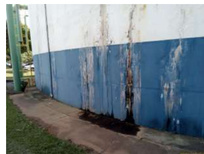
Foto 4 - Detalhe dos vazamentos
