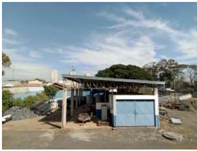
Foto 1 - Sistema de desidratação de lodo fora de operação
