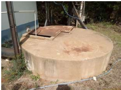
Foto 3 - Poço de sucção
