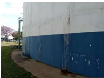
Foto 3 - Detalhe dos vazamentos
