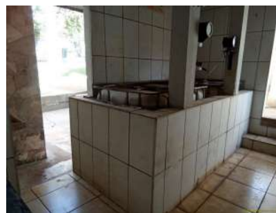
Foto 2 - Estocagem de ácido fluorsilícico, com bacia de contenção
