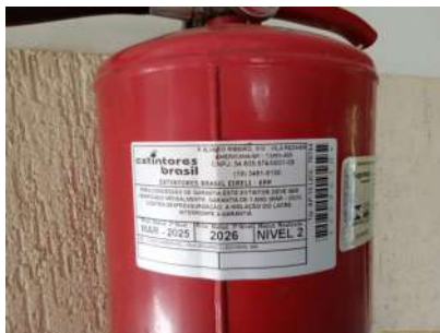
Foto 1 - Extintor de incêndio
