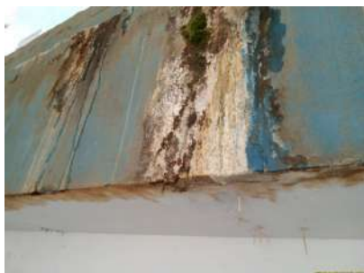
Foto 3 - Detalhe vazamento na lateral do decantador
