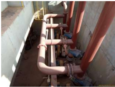
Foto 1 - Vista superior dos conjuntos moto bomba
