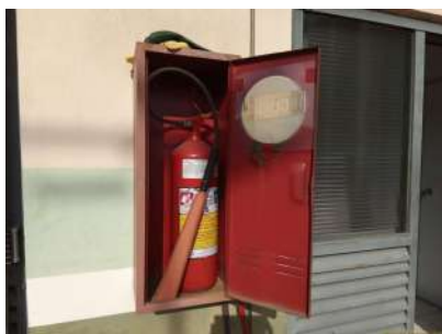
Foto 1 - Extintor de incêndio
