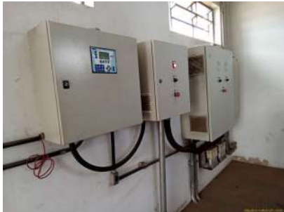
Foto 3 - Painel de comando dos conjuntos motobomba
