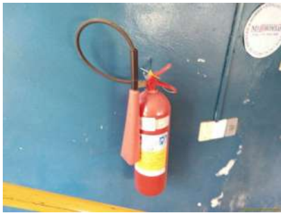
Foto 1 - Extintor de incêndio
