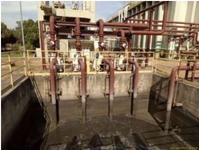
Foto 1 - Poço de sucção
