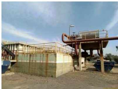
Foto 1 - Vista lateral do tratamento preliminar
