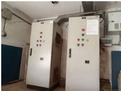
Foto 5 - Painéis de controle dos conjuntos motobomba
