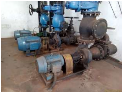
Foto 1 - Conjuntos motobomba em operação e reserva
