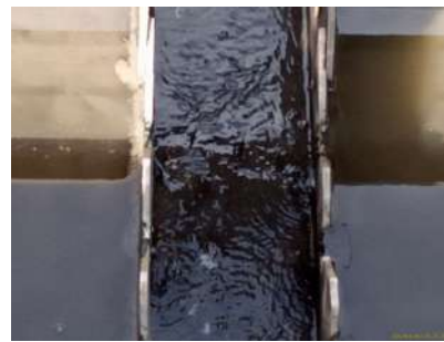
Foto 10 - Saída esgoto tratado do UBOX
