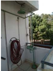
Foto 1 - Chuveiro de emergência
