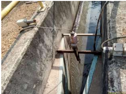
Foto 1 - Medidor de vazão, com telemetria
