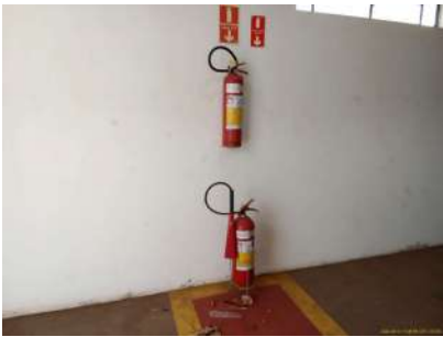
Foto 1 - Extintor de incêndio
