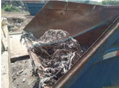
Foto 3 - Armazenamento dos resíduos do gradeamento
