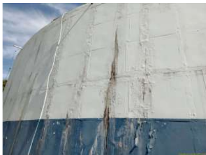
Foto 1 - Detalhe dos vazamentos
