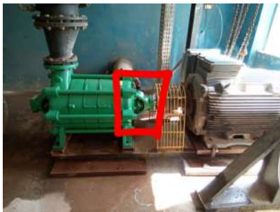
Foto 1 - Detalhe do vazamento no mancal
