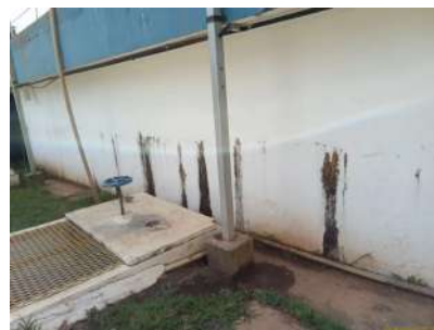
Foto 4 - Detalhe vazamento na lateral do decantador
