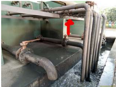
Foto 1 - Vazamento no 3 registro de recirculação de lodo do UBOX 1
