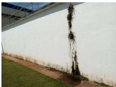
Foto 5 - Detalhe vazamento na lateral do decantador
