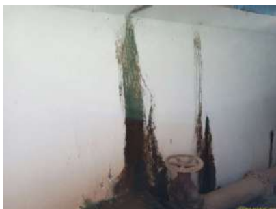
Foto 1 - Detalhe vazamento na lateral do decantador
