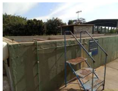
Foto 18 - Tanque de desinfecção
