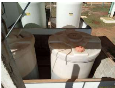
Foto 1 - Estocagem de PAC, com bacia de contenção
