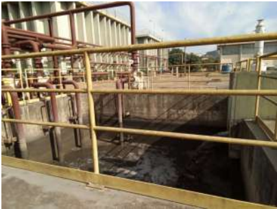
Foto 2 - Vista lateral do poço de sucção
