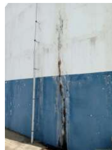
Foto 2 - Detalhe dos vazamentos
