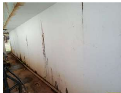
Foto 2 - Detalhe vazamento na lateral do decantador
