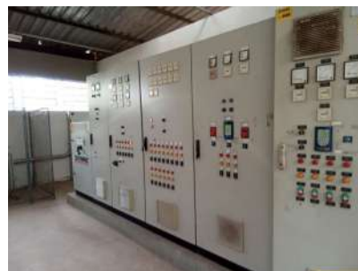
Foto 19 - Pannel de comando da ETE
