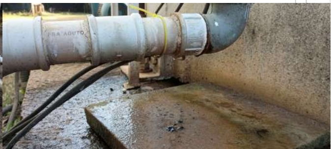
Foto 2 - Vazamento no mesmo local já apontado em 2022.
