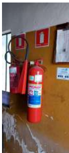
Foto 1 - Extintor de incêndio do local.
