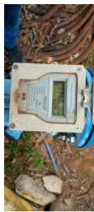
Foto 2 - Macromedidor no cavalete do poço.
