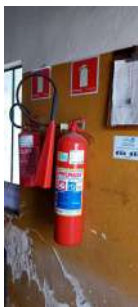
Foto 1 - Extintor de incêndio do local.
