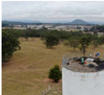
Foto 3 - Haste de captação do SPDA.
