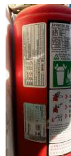
Foto 2 - Validade do extintor de incêndio.
