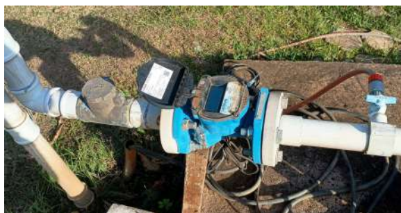
Foto 1 - Macromedidor no cavalete do Poço.
