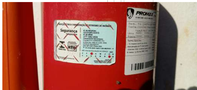
Foto 4 - Validade do extintor de incêndio.
