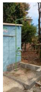
Foto 5 - Chuveiro de emergência.
