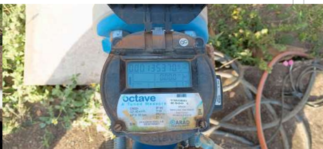
Foto 2 - Macromedidor no cavalete do Poço.
