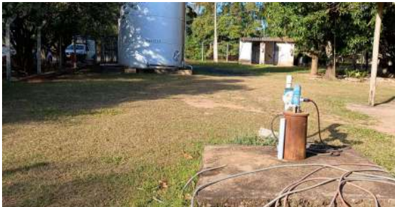
Foto 3 - Vista geral do poço e, ao fundo e à esquerda, o reservatório elevado. Ao fundo e à direita, o abrigo do painel elétrico e de comando e dos tanques de produtos químicos.
