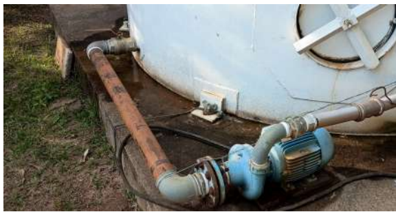
Foto 3 - Novo vazamento, na tubulação entre a câmara inferior do reservatório e o conjunto motobomba.
