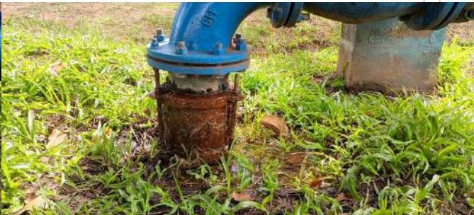
Foto 2 - Detalhe do local do vazamento.
