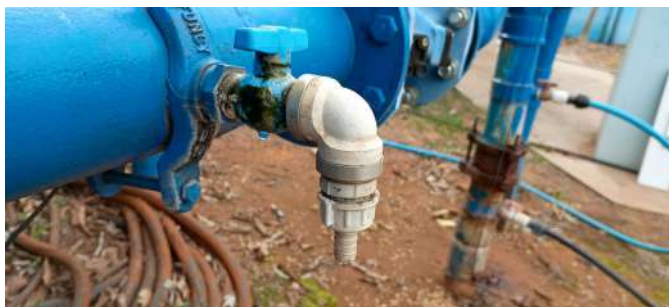
Foto 3 - Vazamento na tornei de tomada de água bruta.
