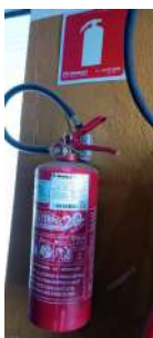
Foto 3 - Validade expirada do extintor de incêndio.
