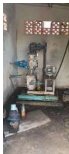
Foto 10 - Vista interna da casa de bombas.
