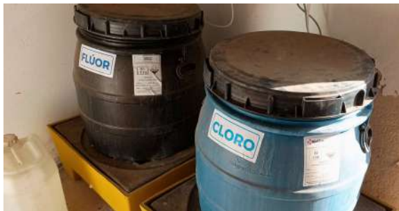
Foto 9 - Tanques de produtos químicos (cloro e flúor).
