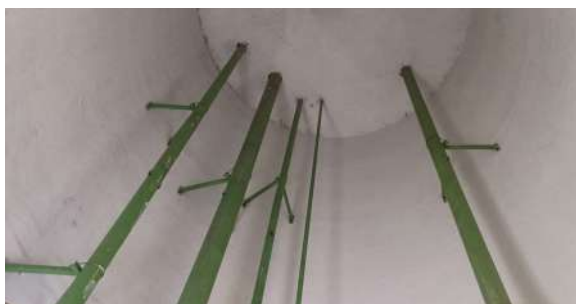
Foto 6 - Tubulações internas do reservatório.
