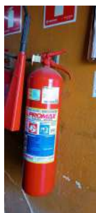
Foto 1 - Validade expirada do extintor de incêndio.
