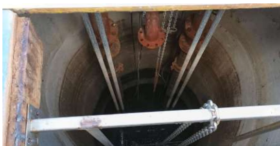
Foto 8 - Conjuntos motobomba submersos instalados.
