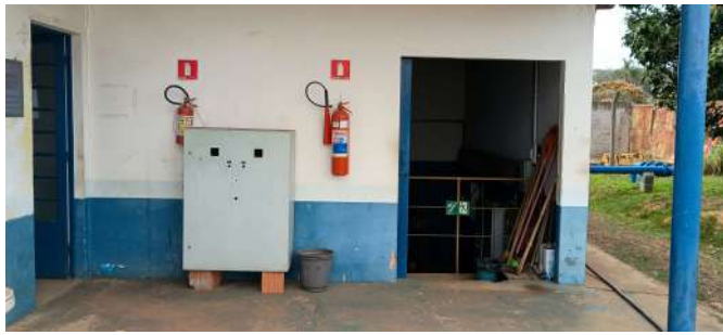
Foto 1 - Extintores de incêndio.
