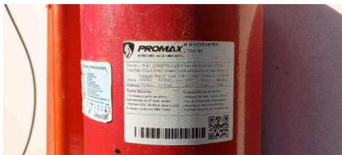
Foto 5 - Validade do extintor de incêndio.
