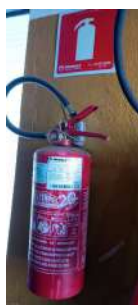
Foto 3 - Validade expirada do extintor de incêndio.
