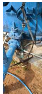
Foto 2 - Aterramento do SPDA.
