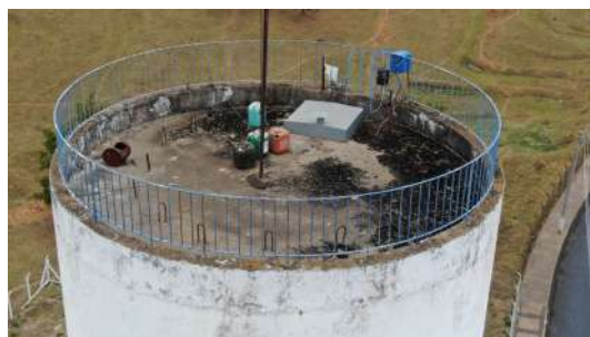
Foto 4 - Haste de captação do SPDA.
