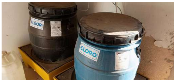
Foto 9 - Tanques de produtos químicos (cloro e flúor).
