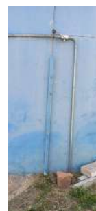
Foto 2 - Aterramento do SPDA.
