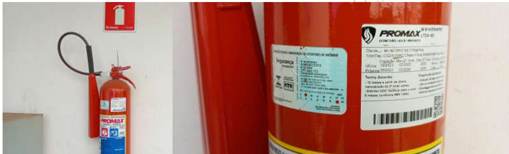
Foto 1 - Extintor de incêndio com validade expirada.
