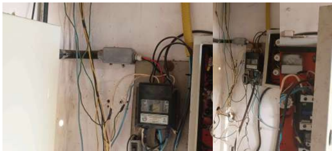
Foto 1 - Fios elétricos expostos.
