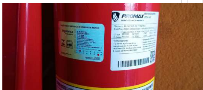
Foto 2 - Validade expirada do extintor de incêndio.
