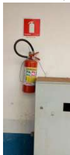
Foto 3 - Extintor de incêndio com validade expirada.
