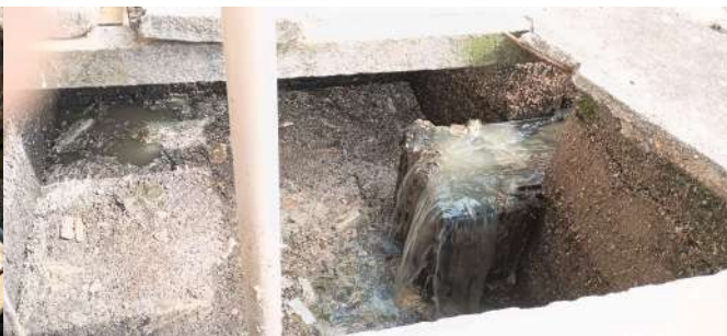
Foto 2 - Situação atual do gradeamento grosseiro.
