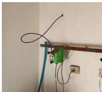
Foto 10 - Bombas dosadoras dos produtos químicos.
