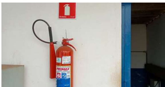
Foto 1 - Extintor de incêndio com validade expirada.
