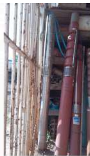
Foto 1 - Motobombas reserva em estoque (Fonte: DAE/Prefeitura Itirapina, ago/2024).
