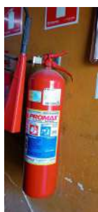
Foto 1 - Validade expirada do extintor de incêndio.
