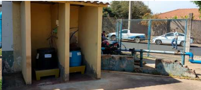
Foto 6 - Abrigos dos tanques de produtos químicos.
