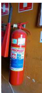
Foto 1 - Validade expirada do extintor de incêndio.
