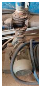
Foto 10 - Segundo conjunto motobomba.
