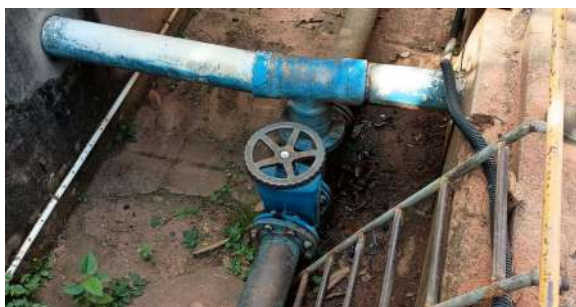
Foto 1 - Vazamentos próximo ao registro, na junção entre as tubulações..
