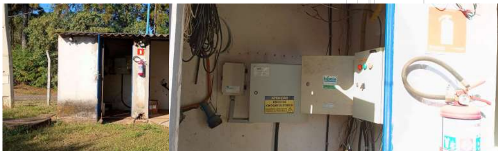
Foto 6 - Abrigo do painel elétrico e de comando e dos tanques de produtos químicos.
