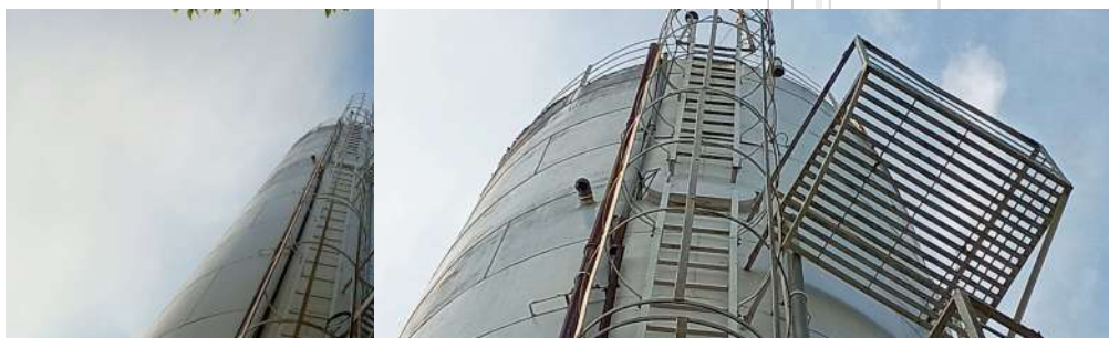
Foto 1 - Ausência de telas de proteção nos tubos extravasores.
