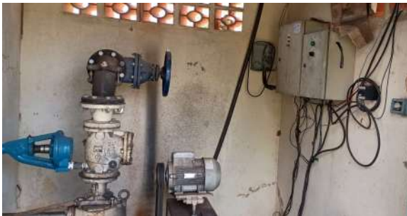
Foto 1 - Situação da fiação elétrica dentro da casa de bombas.
