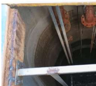
Foto 8 - Conjuntos motobomba submersos instalados.
