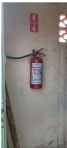
Foto 1 - Extinto de incêndio disponível na EEE.
