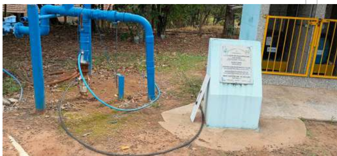
Foto 6 - Dosagem de produtos químicos no cavalete do poço.
