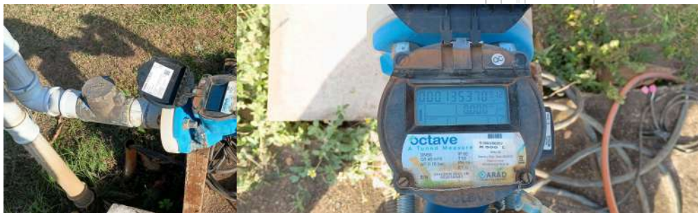
Foto 1 - Macromedidor no cavalete do Poço.
