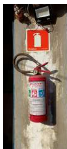
Foto 1 - Extintor de incêndio do local.
