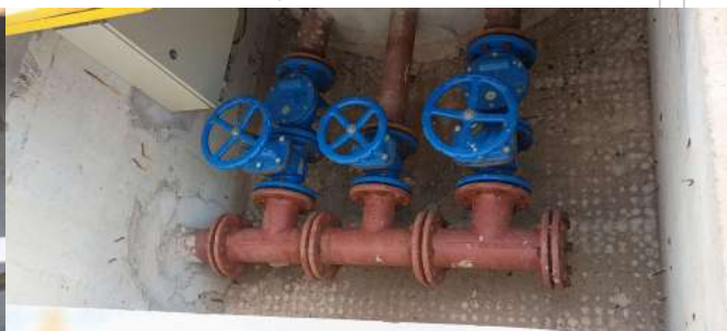
Foto 9 - Barrilete de recalque do esgoto.
