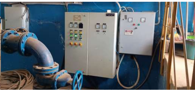
Foto 4 - Painéis elétricos e de comando da EEAT.
