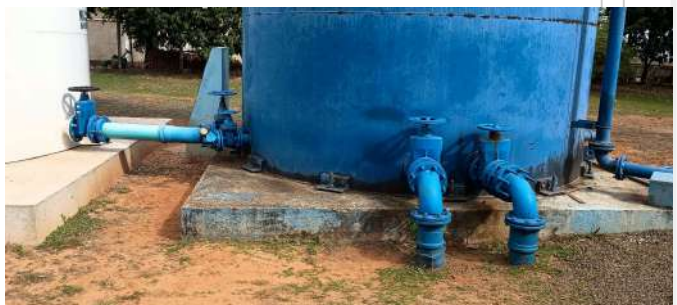
Foto 5 - Tubulações de entrada e saída do reservatório, além da tubulação interligando os dois reservatórios.
