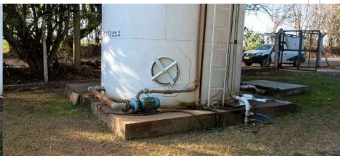
Foto 2 - Vista do conjunto motobomba situado ao lado do reservatório.
