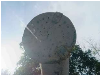
Foto 1 - Proteção contra entrada de insetos e pequenos animais na tubulação de ventilação.
