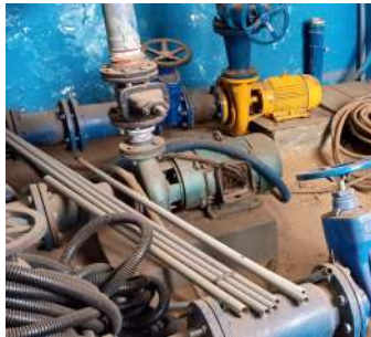
Foto 5 - Conjuntos motobomba da EEAT.
