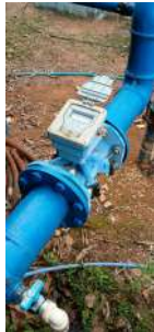
Foto 1 - Macromedidor no cavalete do poço.
