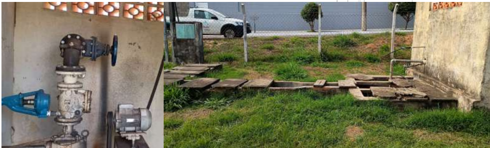
Foto 1 - Situação da fiação elétrica dentro da casa de bombas.
