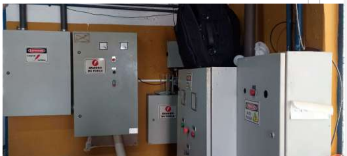
Foto 8 - Painéis elétricos e de comando do poço e da antiga EEAT (desativada).
