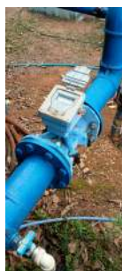
Foto 1 - Macromedidor no cavalete do poço.
