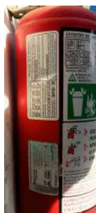
Foto 2 - Validade do extintor de incêndio.
