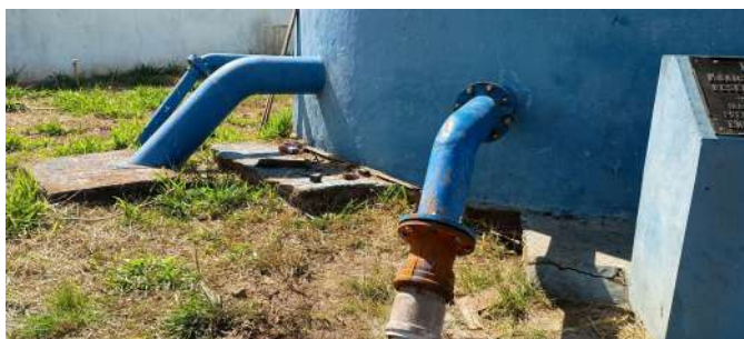
Foto 3 - Tubulações de chegada e saída para abastecimento.
