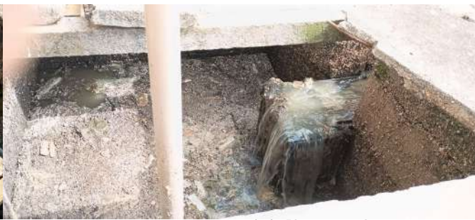
Foto 2 - Situação atual do gradeamento grosseiro.
