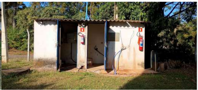
Foto 6 - Abrigo do painel elétrico e de comando e dos tanques de produtos químicos.
