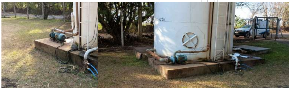
Foto 1 - Vista do conjunto motobomba situado ao lado do reservatório.
