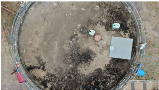
Foto 1 - Ausência de tubulação ou outra estrutura de ventilação na laje do reservatório.
