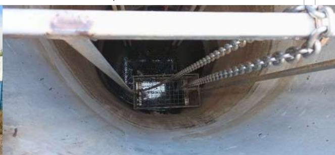
Foto 7 - Cesto de gradeamento no interior do poço.
