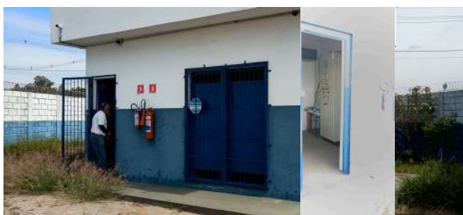
Foto 3 - Abrigo do gerador elétrico a diesel e painel elétrico e de comando.
