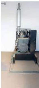
Foto 10 - Gerador elétrico a diesel da EEE.
