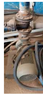
Foto 10 - Segundo conjunto motobomba.
