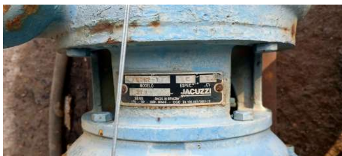
Foto 5 - Placa de especificações gerais do conjunto motobomba.
