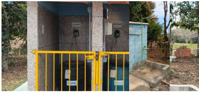
Foto 4 - Abrigo dos tanques de produtos químicos e bombas dosadoras.
