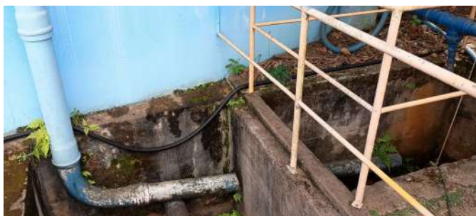
Foto 3 - Vazamentos na base do reservatório.
