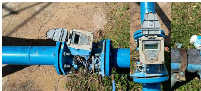
Foto 1 - Macromedidor no cavalete do Poço.
