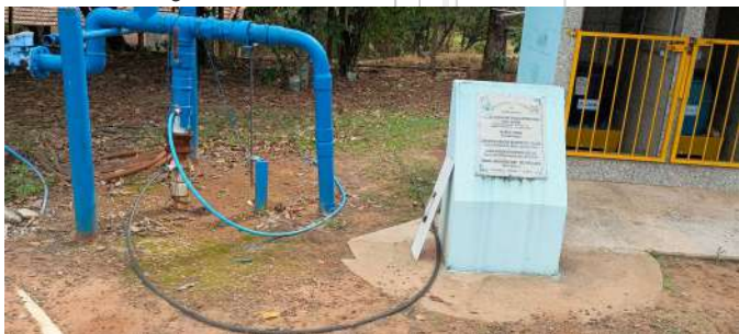
Foto 6 - Dosagem de produtos químicos no cavalete do poço.
