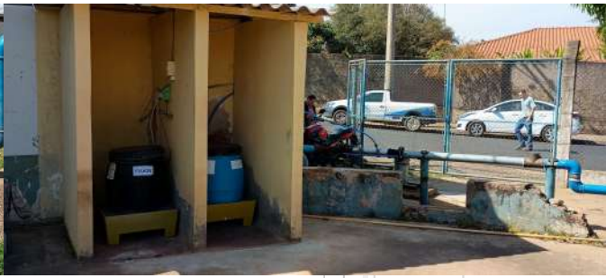
Foto 6 - Abrigos dos tanques de produtos químicos.
