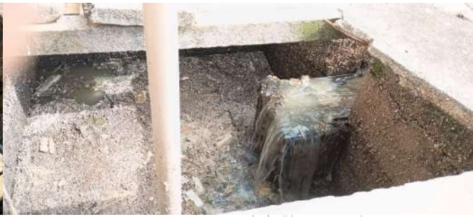
Foto 2 - Situação atual do gradeamento grosseiro.
