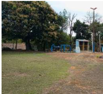
Foto 1 - Vista geral da área, com os dois reservatórios elevados e, ao fundo, o poço.
