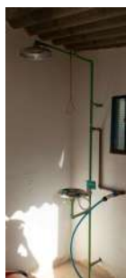
Foto 8 - Chuveiro de emergência.
