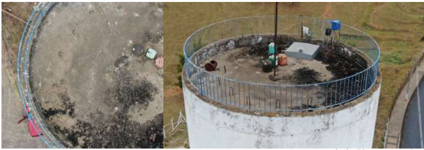
Foto 1 - Ausência de tubulação ou outra estrutura de ventilação na laje do reservatório.
