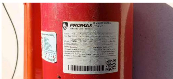
Foto 5 - Validade do extintor de incêndio.
