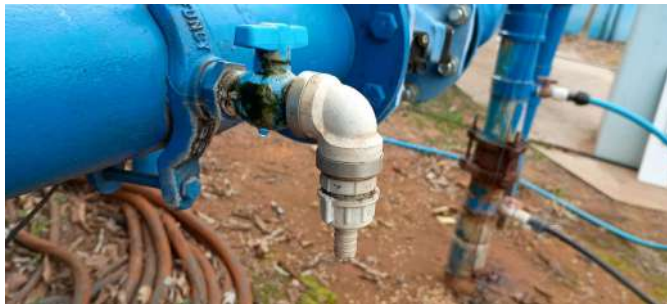
Foto 3 - Vazamento na torneira de tomada de água bruta.
