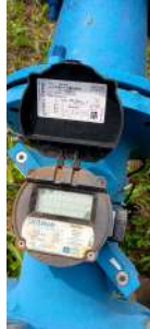
Foto 13 - Macromedidor na tubulação de saída da EEAT.
