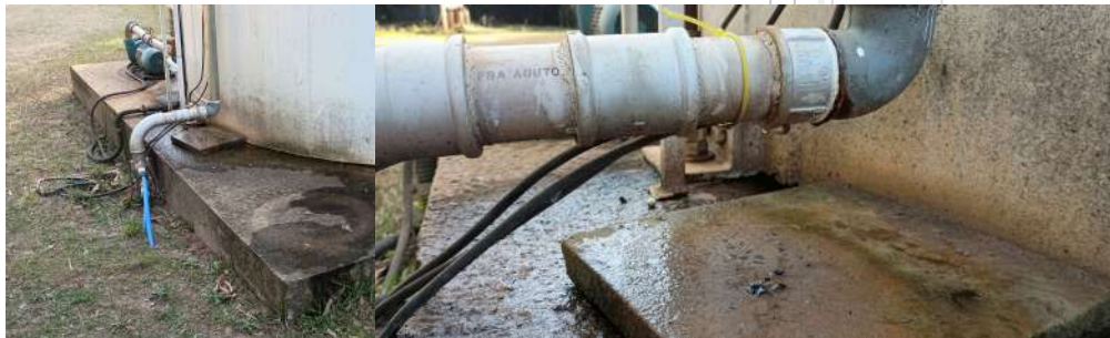
Foto 1 - Base do reservatório com piso molhado devido aos vazamentos.
