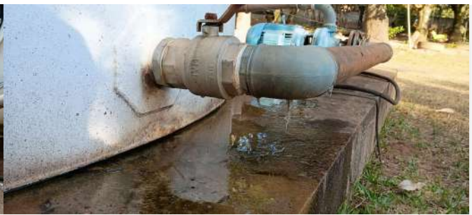
Foto 4 - Novo vazamento, na tubulação entre a câmara inferior do reservatório e o conjunto motobomba.
