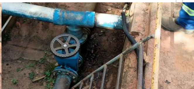
Foto 2 - Vazamentos próximo ao registro, na junção entre as tubulações..
