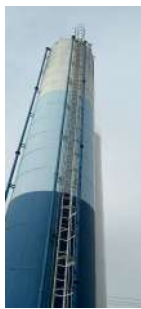
Foto 1 - Sistema de descida do SPDA.
