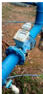
Foto 1 - Macromedidor no cavalete do poço.
