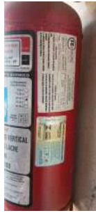
Foto 1 - Extintor de incêndio com validade vencida.
