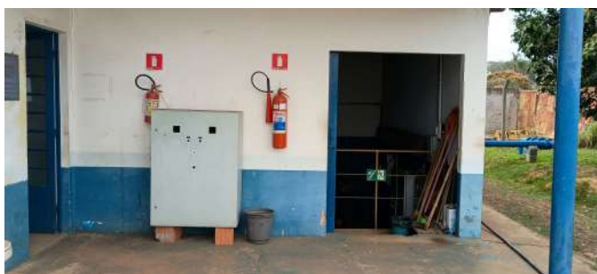
Foto 1 - Extintores de incêndio.
