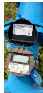
Foto 13 - Macromedidor na tubulação de saída da EEAT.
