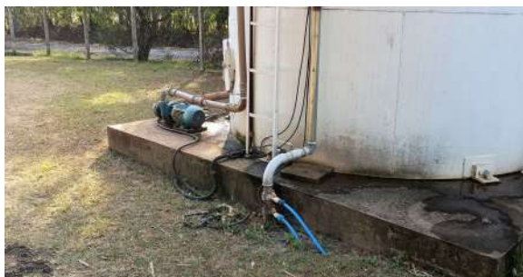
Foto 1 - Vista do conjunto motobomba situado ao lado do reservatório.
