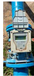
Foto 2 - Macromedidor no cavalete do Poço.
