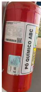
Foto 4 - Extintor de incêndio com validade expirada.
