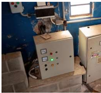
Foto 3 - Painéis elétricos e de comando da EEAT.
