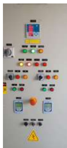
Foto 5 - Vista do painel elétrico e de comando.
