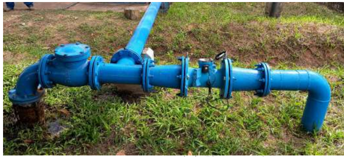
Foto 12 - Macromedidor na tubulação de saída da EEAT.
