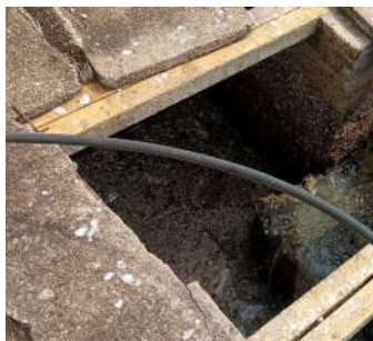
Foto 1 - Situação atual do gradeamento grosseiro.
