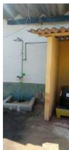
Foto 7 - Chuveiro de emergência do local.
