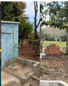
Foto 5 - Chuveiro de emergência.
