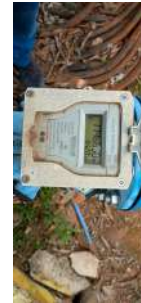
Foto 2 - Macromedidor no cavalete do poço.
