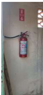
Foto 1 - Extinto de incêndio disponível na EEE.
