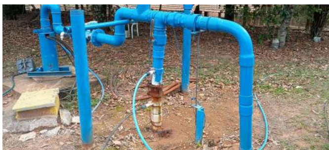
Foto 1 - Vazamento próximo ao ponto de aplicação do cloro e flúor.
