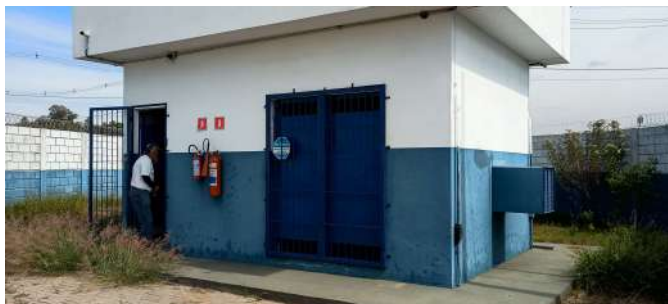
Foto 3 - Abrigo do gerador elétrico a diesel e painel elétrico e de comando.
