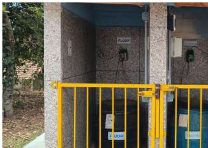
Foto 4 - Abrigo dos tanques de produtos químicos e bombas dosadoras.
