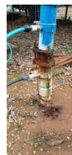
Foto 2 - Vazamento próximo ao ponto de aplicação do cloro e flúor.
