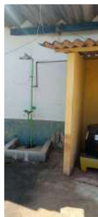
Foto 7 - Chuveiro de emergência do local.
