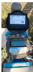
Foto 3 - Macromedidor no cavalete do Poço.
