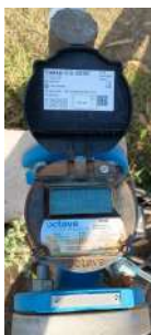
Foto 3 - Macromedidor no cavalete do Poço.
