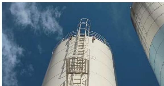
Foto 1 - Tubos extravasores com proteção contra entrada de insetos e pequenos animais.
