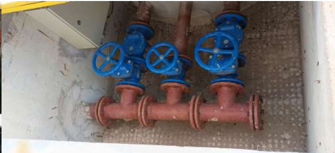
Foto 9 - Barrilete de recalque do esgoto.
