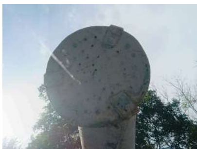
Foto 1 - Proteção contra entrada de insetos e pequenos animais na tubulação de ventilação.
