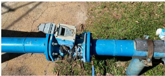
Foto 1 - Macromedidor no cavalete do Poço.
