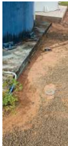
Foto 3 - Aterramento do SPDA.
