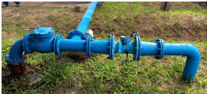
Foto 12 - Macromedidor na tubulação de saída da EEAT.
