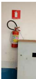
Foto 3 - Extintor de incêndio com validade expirada.
