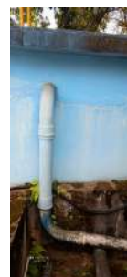
Foto 4 - Vazamentos na base do reservatório.
