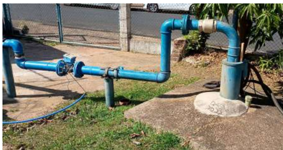
Foto 5 - Poço e cavalete.
