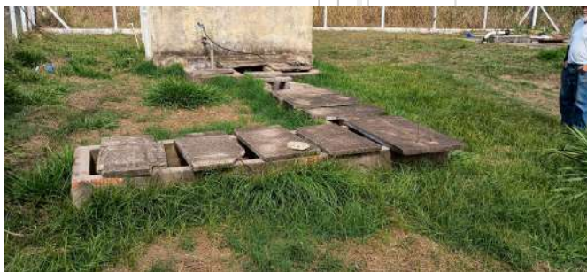
Foto 7 - Canal de chegada do esgoto bruto (parte inferior) e casa de bombas (parte superior).
