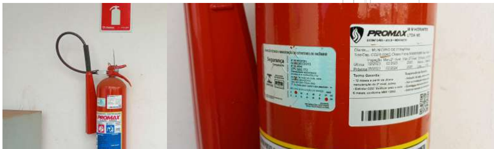
Foto 1 - Extintor de incêndio com validade expirada. Foto 2 - Extintor de incêndio com validade expirada.
