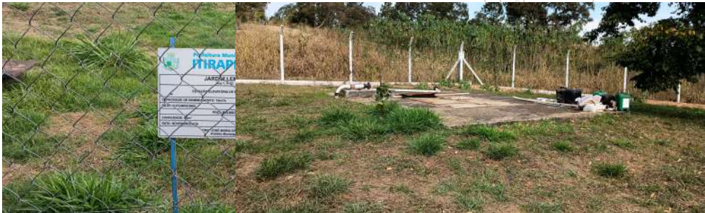
Foto 3 - Placa de identificação da EEE. Foto 4 - Vista do reservatório de acumulação (pulmão)
