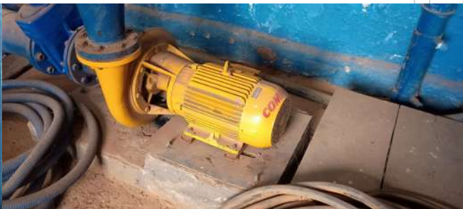
Foto 8 - Terceiro conjunto motobomba.
