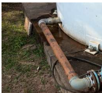
Foto 3 - Novo vazamento, na tubulação entre a câmara inferior do reservatório e o conjunto motobomba.
