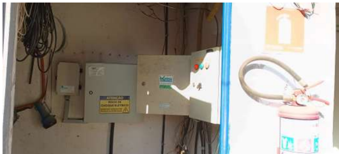
Foto 7 - Painéis elétricos e de comando do poço.
