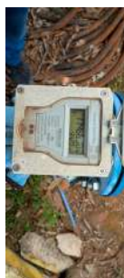
Foto 2 - Macromedidor no cavalete do poço.
