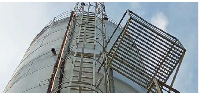
Foto 2 - Ausência de telas de proteção nos tubos extravasores.
