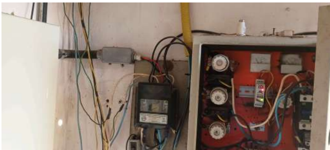
Foto 1 - Fios elétricos expostos.
