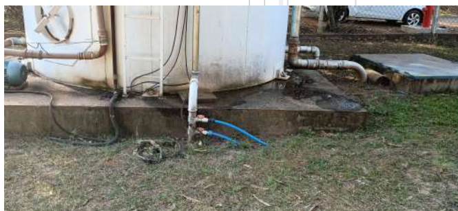
Foto 5 - Ponto de aplicação dos produtos químicos na tubulação antes do reservatório.
