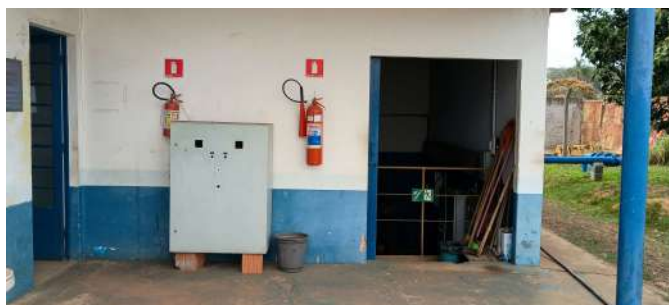
Foto 1 - Extintores de incêndio.
