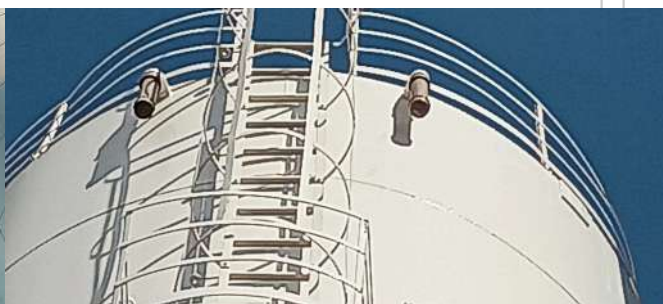
Foto 2 - Tubos extravasores com proteção contra entrada de insetos e pequenos animais.
