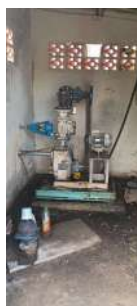
Foto 10 - Vista interna da casa de bombas.
