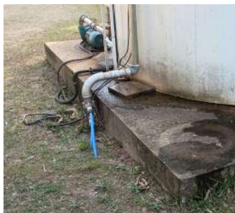
Foto 1 - Base do reservatório com piso molhado devido aos vazamentos.
