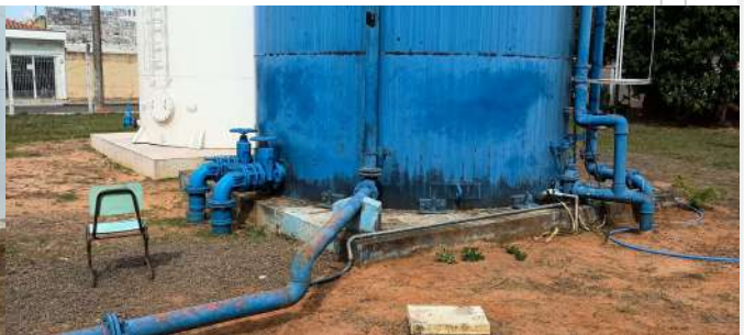
Foto 4 - Tubulações de entrada e saída do reservatório.
