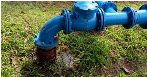
Foto 1 - Detalhe do local do vazamento.
