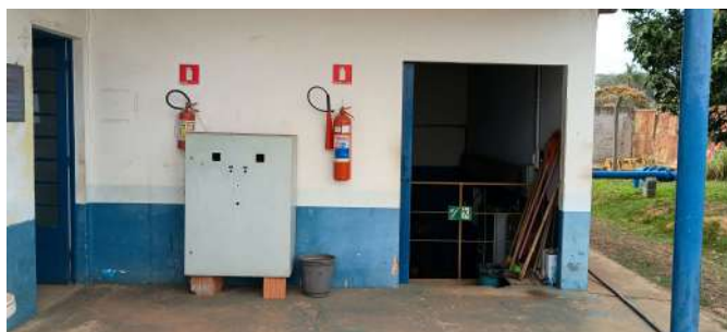
Foto 1 - Extintores de incêndio.
