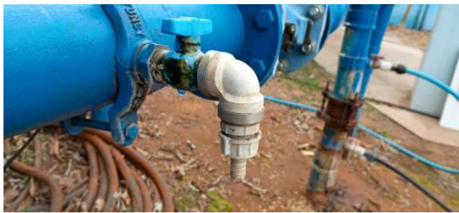
Foto 3 - Vazamento na tornei de tomada de água bruta.
