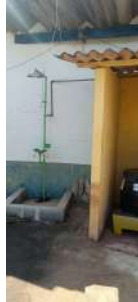
Foto 7 - Chuveiro de emergência do local.
