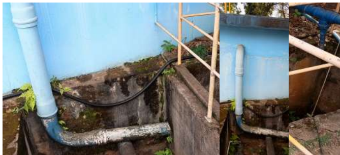
Foto 3 - Vazamentos na base do reservatório.
