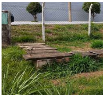
Foto 5 - Canal de chegada do esgoto bruto (esquerda), poço de sucção e casa de bombas (direita).
