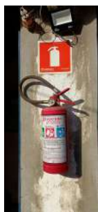
Foto 1 - Extintor de incêndio do local.
