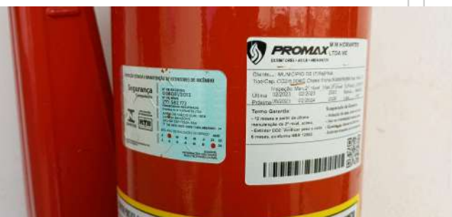
Foto 2 - Extintor de incêndio com validade expirada.
