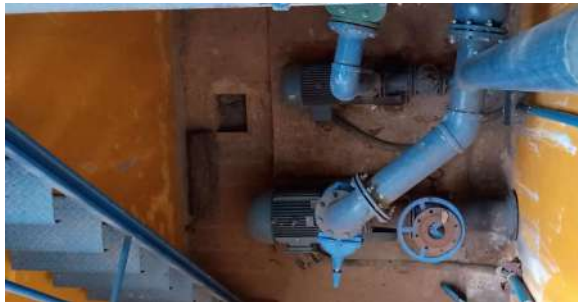
Foto 1 - Vista interna da EEAT e dos conjuntos motobomba instalados.
