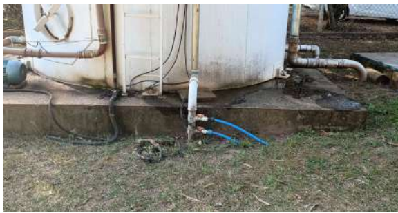
Foto 5 - Ponto de aplicação dos produtos químicos na tubulação antes do reservatório.
