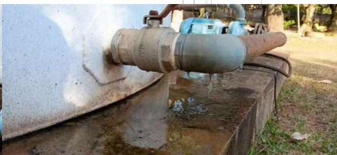
Foto 4 - Novo vazamento, na tubulação entre a câmara inferior do reservatório e o conjunto motobomba.
