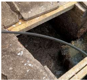
Foto 1 - Situação atual do gradeamento grosseiro.
