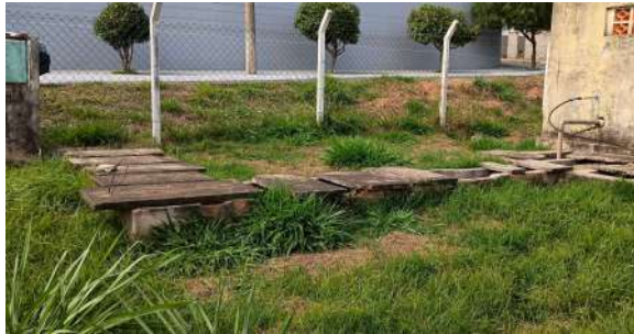
Foto 5 - Canal de chegada do esgoto bruto (esquerda), poço de sucção e casa de bombas (direita).
