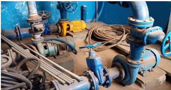
Foto 5 - Conjuntos motobomba da EEAT.
