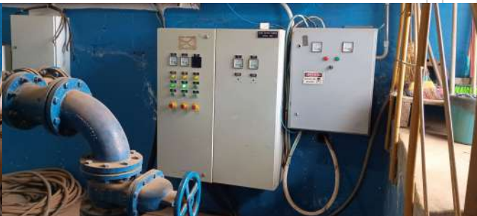
Foto 4 - Painéis elétricos e de comando da EEAT.
