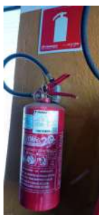
Foto 3 - Validade expirada do extintor de incêndio.
