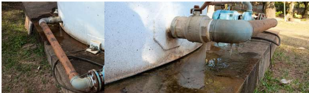
Foto 3 - Novo vazamento, na tubulação entre a câmara inferior do reservatório e o conjunto motobomba.
