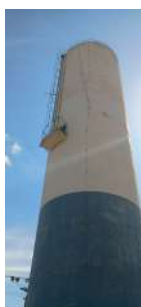
Foto 1 - Sistema de descida do SPDA.
