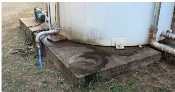
Foto 1 - Base do reservatório com piso molhado devido aos vazamentos.
