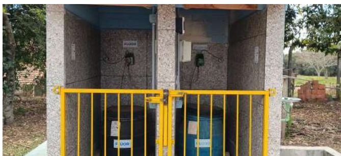
Foto 4 - Abrigo dos tanques de produtos químicos e bombas dosadoras.
