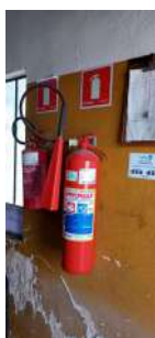
Foto 1 - Extintor de incêndio do local.
