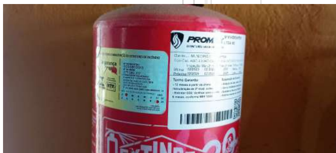
Foto 4 - Validade expirada do extintor de incêndio.
