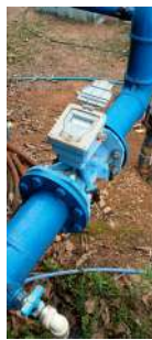
Foto 1 - Macromedidor no cavalete do poço.
