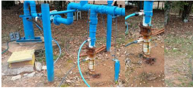
Foto 1 - Vazamento próximo ao ponto de aplicação do cloro e flúor. Foto 2 - Vazamento próximo ao ponto de aplicação do cloro e flúor.
