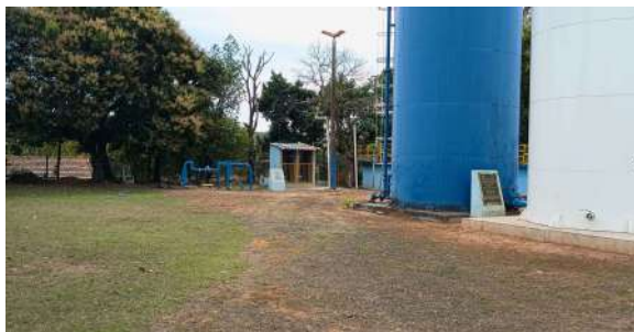
Foto 1 - Vista geral da área, com os dois reservatórios elevados e, ao fundo, o poço.
