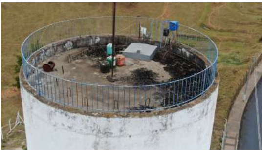
Foto 2 - Ausência de tubulação ou outra estrutura de ventilação na laje ou lateral do reservatório
