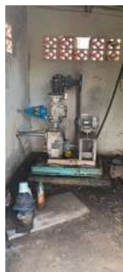
Foto 10 - Vista interna da casa de bombas.
