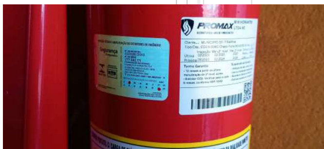
Foto 2 - Validade expirada do extintor de incêndio.
