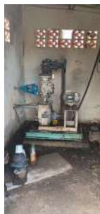
Foto 10 - Vista interna da casa de bombas.
