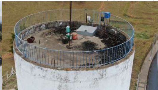
Foto 4 - Haste de captação do SPDA.
