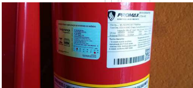
Foto 2 - Validade expirada do extintor de incêndio.
