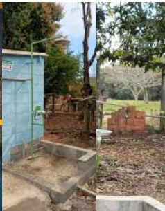
Foto 5 - Chuveiro de emergência.
