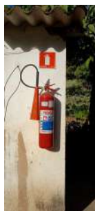
Foto 3 - Extintor de incêndio do local.
