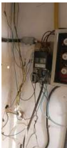
Foto 2 - Fios elétricos expostos.
