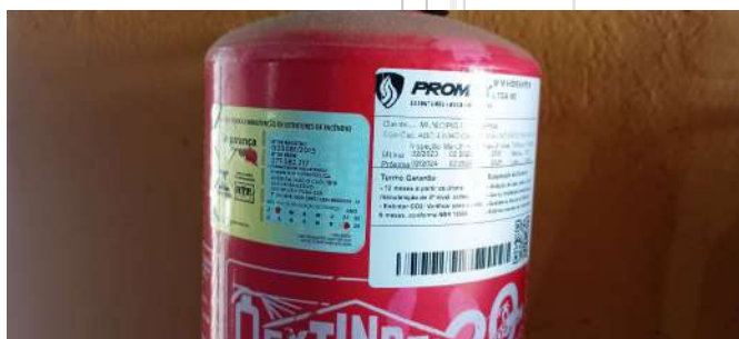
Foto 4 - Validade expirada do extintor de incêndio.
