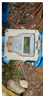
Foto 2 - Macromedidor no cavalete do poço.
