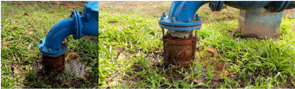
Foto 1 - Detalhe do local do vazamento. Foto 2 - Detalhe do local do vazamento.
