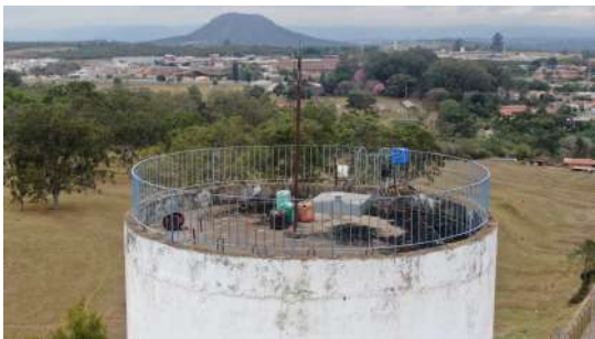
Foto 3 - Ausência de tubulação ou outra estrutura de ventilação na laje ou lateral do reservatório
