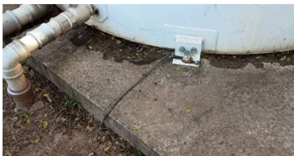
Foto 1 - Aterramento da estrutura metálica usada como sistema de descida do SPDA.
