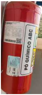
Foto 4 - Extintor de incêndio com validade expirada.
