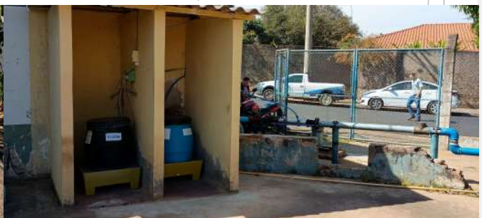
Foto 6 - Abrigos dos tanques de produtos químicos.
