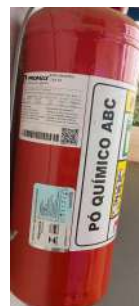
Foto 4 - Extintor de incêndio com validade expirada.
