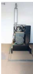
Foto 10 - Gerador elétrico a diesel da EEE.
