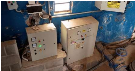
Foto 3 - Painéis elétricos e de comando da EEAT.
