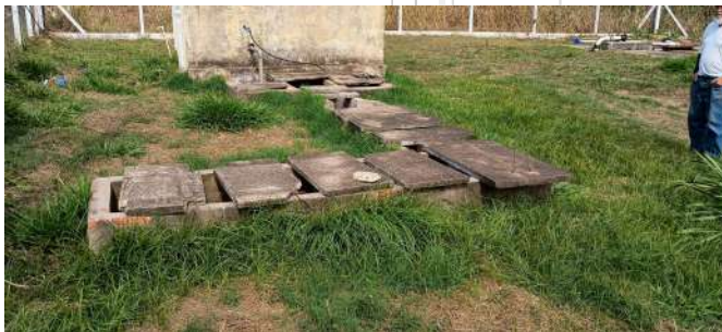
Foto 7 - Canal de chegada do esgoto bruto (parte inferior) e casa de bombas (parte superior).
