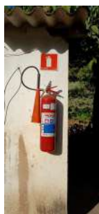
Foto 3 - Extintor de incêndio do local.
