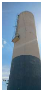
Foto 1 - Sistema de descida do SPDA.
