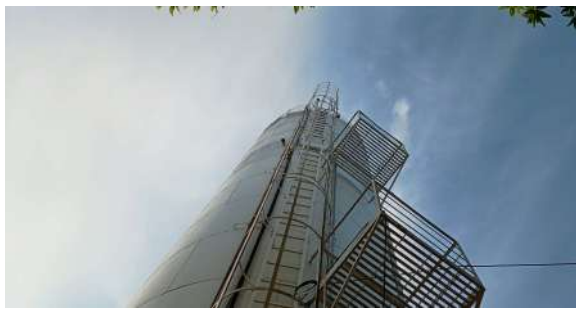
Foto 1 - Ausência de telas de proteção nos tubos extravasores.
