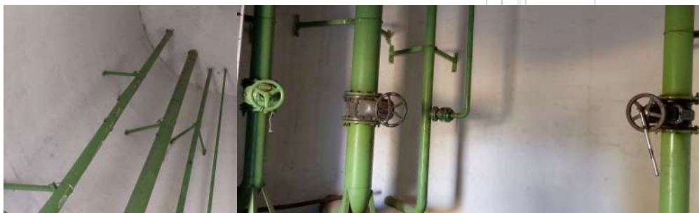
Foto 6 - Tubulações internas do reservatório.
