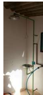
Foto 8 - Chuveiro de emergência.
