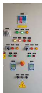
Foto 5 - Vista do painel elétrico e de comando.
