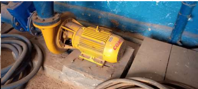
Foto 8 - Terceiro conjunto motobomba.
