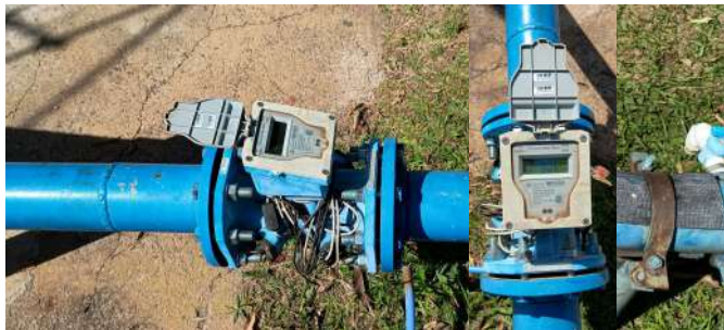
Foto 1 - Macromedidor no cavalete do Poço.
