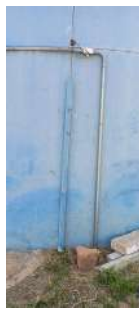
Foto 2 - Aterramento do SPDA.
