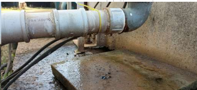
Foto 2 - Vazamento no mesmo local já apontado em 2022.
