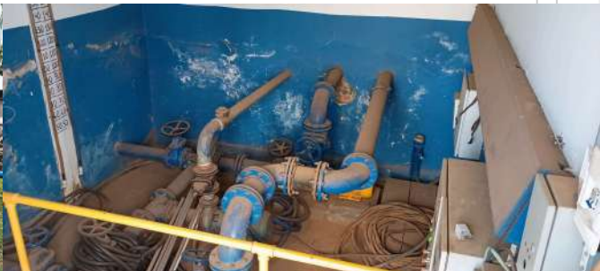
Foto 2 - Vista interna da EEAT.
