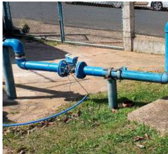
Foto 5 - Poço e cavalete.
