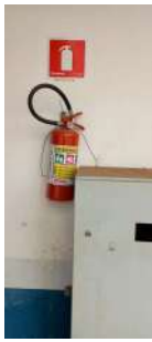
Foto 3 - Extintor de incêndio com validade expirada.
