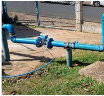
Foto 5 - Poço e cavalete.
