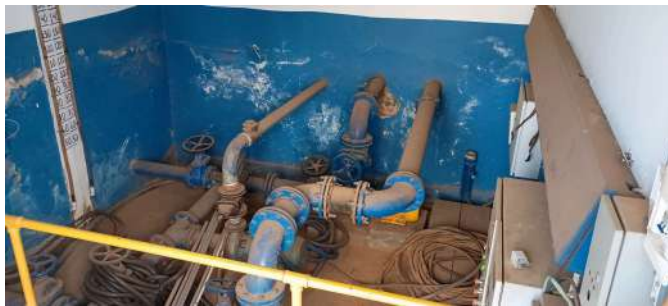
Foto 1 - Medidor de nível.
