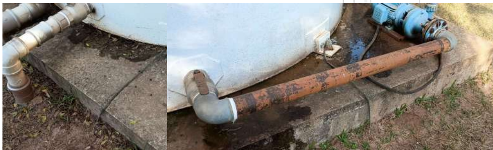
Foto 1 - Aterramento da estrutura metálica usada como sistema de descida do SPDA.
