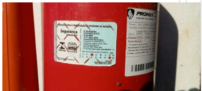
Foto 4 - Validade do extintor de incêndio.
