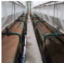
Foto 13 - Dois decantadores da ETA compacta.
