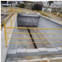
Foto 6 - Decantador da ETA convencional.
