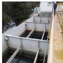
Foto 22 - 5 filtros na ETA metálica.
