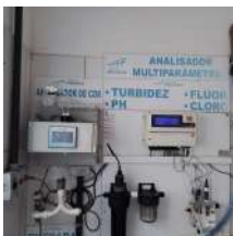
Foto 2 - Equipamento para monitoramento dos parâmetros básicos de qualidade da água.
