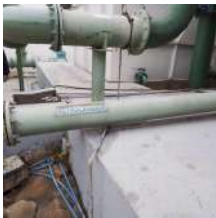
Foto 23 - Tubulação para retrolavagem dos filtros.
