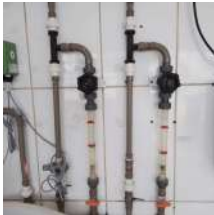
Foto 7 - Tubulações que encaminham hipoclorito de sódio para pré e pós cloração.
