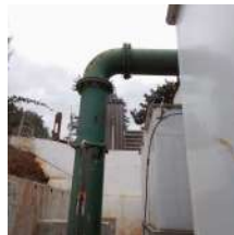
Foto 16 - Entrada de água bruta na ETA metálica.
