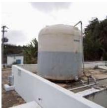
Foto 3 - Contenção ao redor do tanque de PAC.
