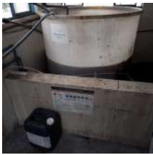
Foto 5 - Tanque para armazenamento e dosagem de PAC.
