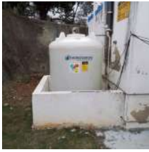
Foto 7 - Armazenamento de hipoclorito de sódio, gerado por sistema de produção próprio a partir de cloreto de sódio.
