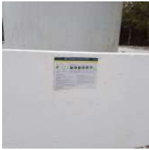
Foto 2 - Tanque para armazenamento de PAC
