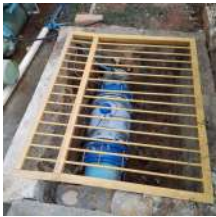
Foto 5 - Macromedidor na entrada ETA metálica.
