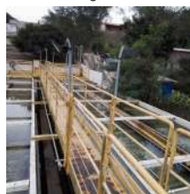
Foto 18 - 2 decantadores na ETA metálica.
