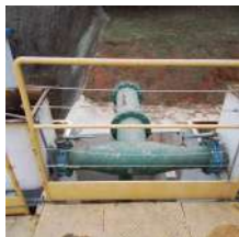
Foto 21 - Entrada de água bruta nos decantadores da ETA metálica.
