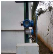
Foto 3 - Display do medidor de vazão da entrada ETA metálica.
