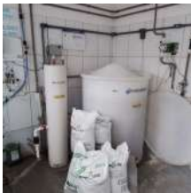
Foto 3 - Armazenamento de cloreto de sódio, insumo utilizado no processo de geração de cloro.
