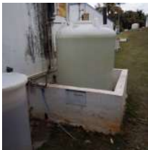
Foto 9 - Tanque para armazenamento de hipoclorito de sódio.
