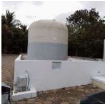
Foto 1 - Tanque para armazenamento de PAC
