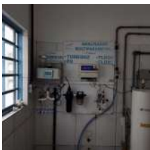
Foto 1 - Equipamento para monitoramento dos parâmetros básicos de qualidade da água.
