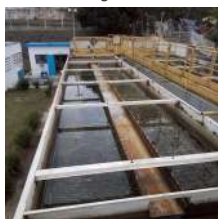
Foto 17 - 2 decantadores na ETA metálica.
