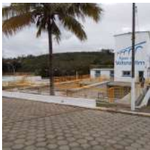
Foto 1 - Visão geral da ETA convencional, passando por retrofit. A frente os dois decantadores.
