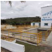
Foto 2 - Os dois decantadores da ETA convencional.
