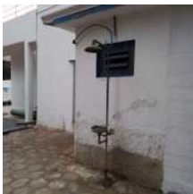
Foto 1 - Chuveiro de emergência.
