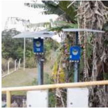
Foto 6 - Medidores de vazão nas saídas para os centros de reservação Itapeva e São João.
