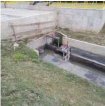
Foto 3 - Entrada do efluente na caixa de areia.
