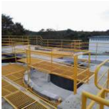
Foto 5 - Floculadores hidráulicos: também passaram por reforma para retrofit. Observa-se que faltam instalações eletromecânicas.
