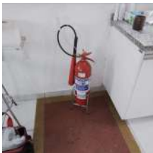
Foto 1 - Extintor na ETA
