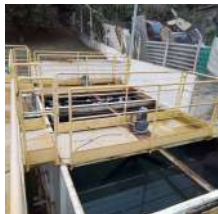
Foto 19 - 4 floculadores na ETA metálica
