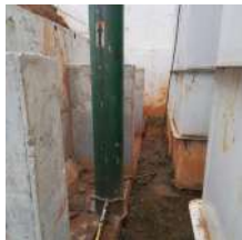
Foto 15 - Entrada de água bruta na ETA metálica.
