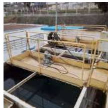
Foto 20 - Floculador da ETA metálica, com misturador hidráulico.
