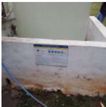
Foto 10 - Identificação do hipoclorito de sódio.
