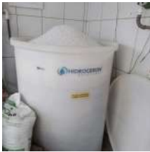
Foto 5 - Armazenamento de cloreto de sódio, insumo utilizado no processo de geração de cloro.
