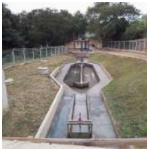
Foto 2 - Caixa de areia integrante da estrutura antiga, ainda em operação na ocasião da Fiscalização.
