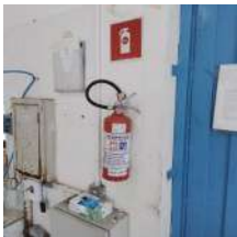
Foto 2 - Extintor na ETA.
