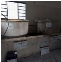
Foto 4 - Armazenamento de PAC e ácido fluossilícico para dosagem no tratamento.
