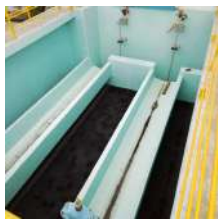
Foto 9 - Filtro da ETA.
