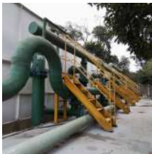
Foto 24 - Vista dos filtros da ETA compacta metálica.
