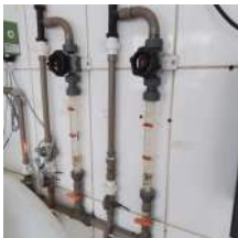
Foto 8 - Tubulações que encaminham hipoclorito de sódio para pré e pós cloração.
