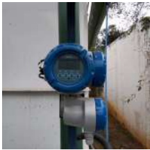
Foto 4 - Display do medidor de vazão da entrada ETA metálica.
