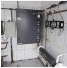
Foto 2 - Painel do gerador de cloro.
