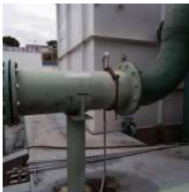
Foto 12 - Ponto de aplicação de cloro da ETA compacta.
