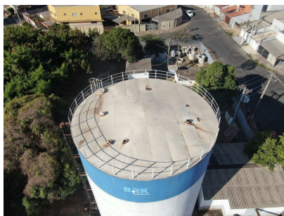
Foto 1 - Tubulações de ventilação oxidadas
