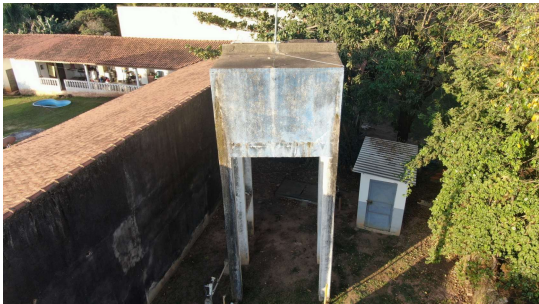
Foto 1 - Não há guarda-corpo na coberura do reservatório
