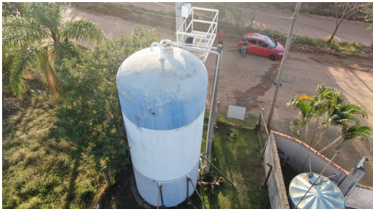
Foto 1 - Ausência de guarda-rorpo na cobertura do reservatório
