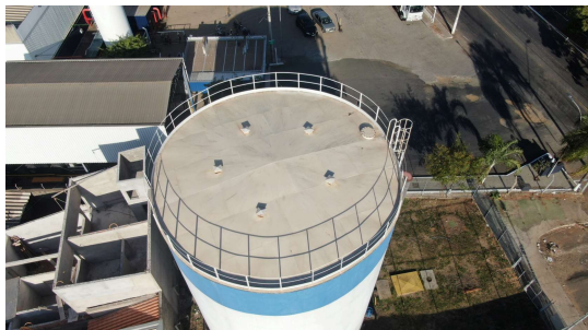
Foto 1 - Reservatório com tubulações de ventilação
