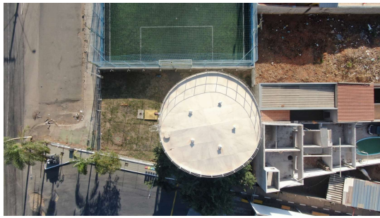
Foto 1 - Ausência de pára-raio no reservatório
