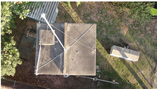
Foto 1 - Pára-raio do reservatório
