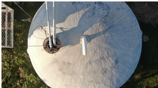
Foto 1 - Ausência de fechamento da abertura de entrada da água
