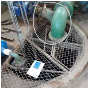
Foto 4 - Poço de sucção
