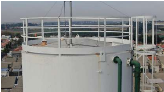
Foto 1 - Ventilação sem tela de proteção contra entrada de insetos e pequenos animais
