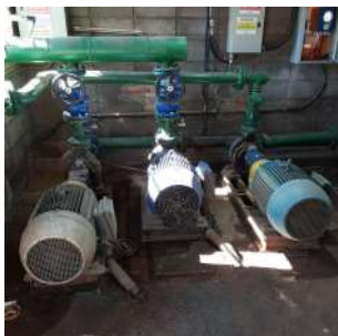
Foto 1 - Conjuntos motobomba instalados
