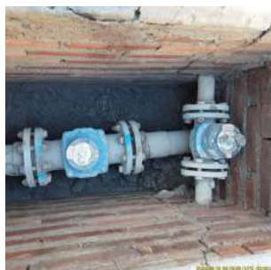
Foto 1 - Macromedidor de saída
