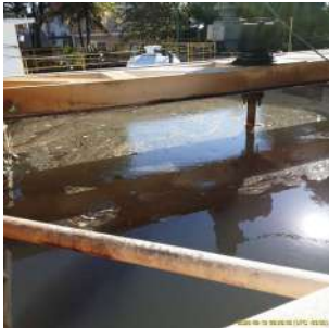
Foto 2 - Flocculador da ETA CPH
