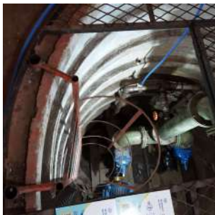
Foto 1 - Escada de acesso aos conjuntos motobomba com guarda-corpo
