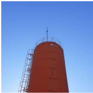
Foto 1 - Pára-raio instalado na cobertura do reservatório
