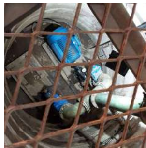
Foto 2 - Detalhamento do conjunto motobomba instalado
