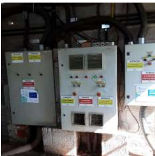
Foto 1 - Painel de controle dos conjuntos motobomba
