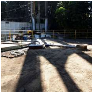
Foto 1 - Cobertura do reservatório com materiais dispostos na superfície.
