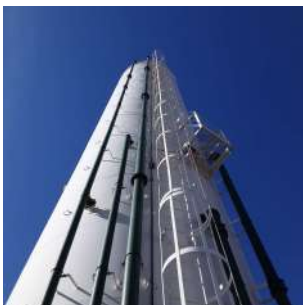
Foto 2 - Detalhe do aterramento do pára-raio
