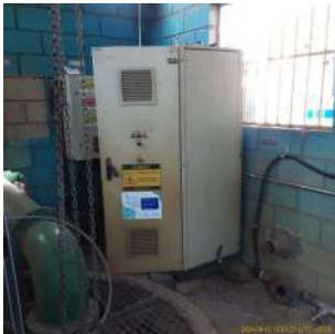
Foto 3 - Painele de controle dos conjuntos motobomba
