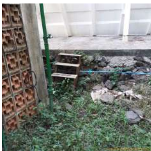
Foto 1 - Escada improvisada em um dos acessos ao booster (ausência de segurança)
