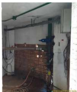
Foto 1 - Local possui acesso para manutenção do Booster
