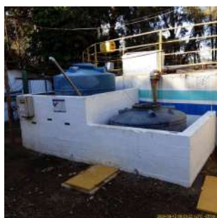
Foto 1 - Tanques de aplicação de cloro e flúor na ETA CPH
