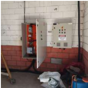
Foto 4 - Painele de controle
