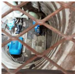
Foto 1 - Não há conjunto motobomba reserva instalado
