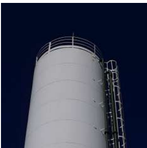
Foto 1 - Pára-raio instalado na cobertura do reservatório
