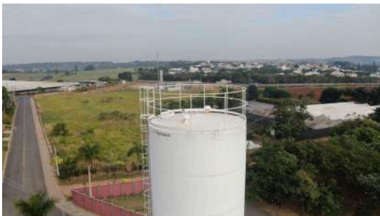
Foto 1 - Tubulações de ventilação na cobertura do reservatório
