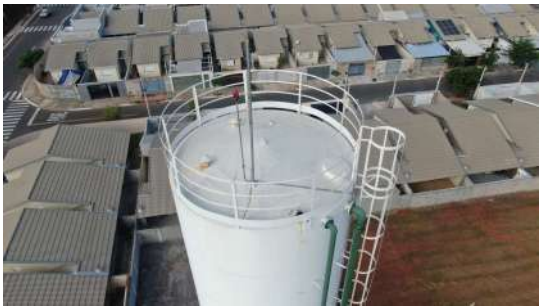
Foto 3 - Detalhamento do pára-raio
