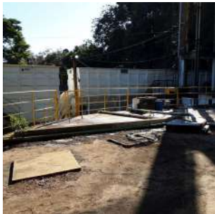
Foto 2 - Cobertura do reservatório com materiais dispostos na superfície.
