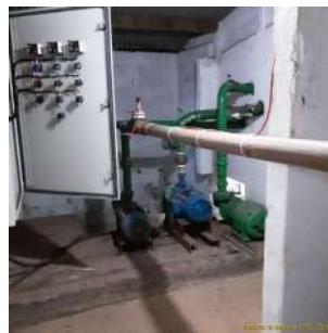
Foto 2 - Conjuntos motobomba instalados
