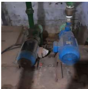
Foto 1 - Conjuntos motobomba instalados
