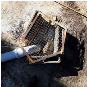
Foto 2 - Tampa de inspeção inadequada/improvisada
