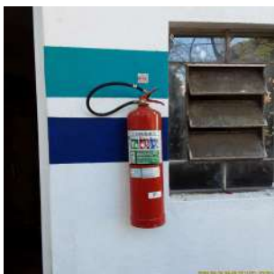
Foto 1 - Extintor de incêndio instalado
