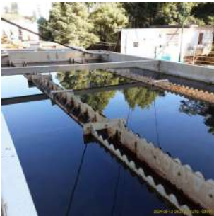
Foto 3 - Decantador da ETA CPH
