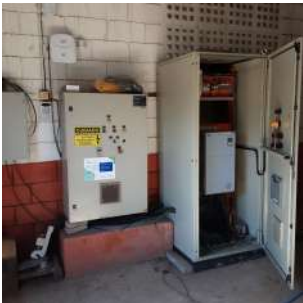
Foto 3 - Painele de controle
