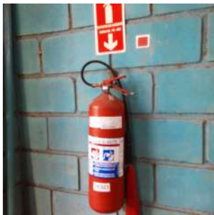
Foto 1 - Extintor de incêndio de pó químico instalado
