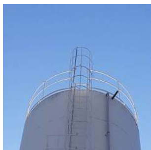
Foto 1 - Pára-raio instalado no reservatório
