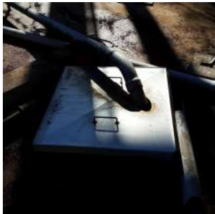
Foto 1 - Tampa de inspeção permite a entrada de insetos , pequenos animais, sujeiras e água da chuva
