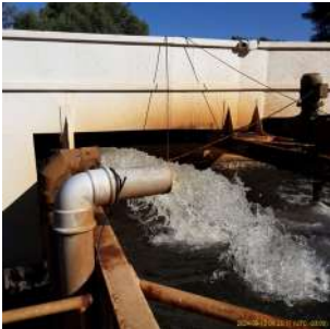
Foto 1 - Entrada da Água na ETA CPH
