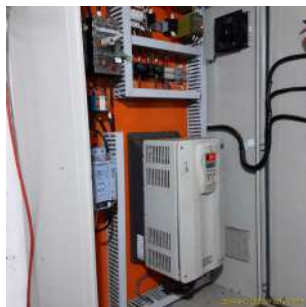
Foto 1 - Painel de controle dos conjuntos motobomba
