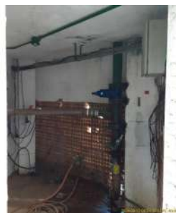
Foto 2 - Local com iluminação precária
