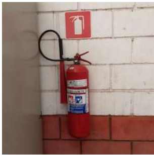
Foto 1 - Extintor de incêndio de CO2
