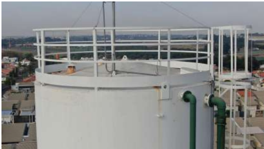
Foto 1 - Detalhamento da tubulação de ventilação
