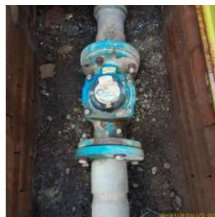
Foto 2 - Macromedidor de saída
