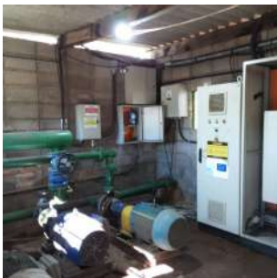
Foto 2 - Painel de controle dos conjuntos motobomba
