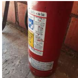
Foto 2 - Próxima manutenção de nível II em abril de 2024
