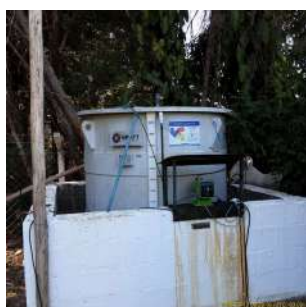
Foto 1 - Contenção ao redor do tanque de PAC
