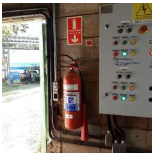
Foto 1 - Extintor de incêndio de CO2 instalado
