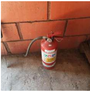
Foto 2 - Extintor de incêndio de pó químico
