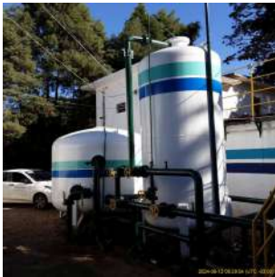
Foto 4 - Filtros da ETA CPH
